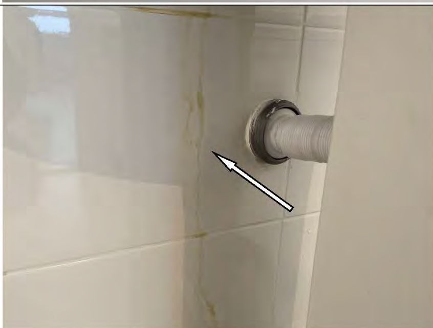
Фото №33. На настенной керамической плитке в ванной комнате имеются дефекты (загрязнения).
