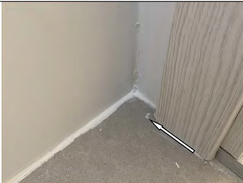
Фото №31. Загрязнение затирочным раствором напольной керамической плитки в санузле.
