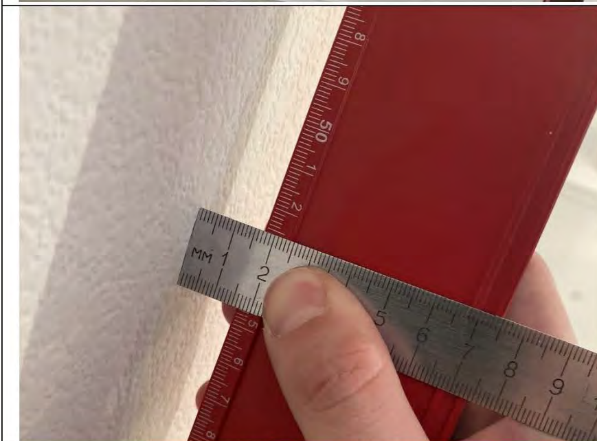
Фото №14. Измерение уровня стен в коридоре в квартире.
