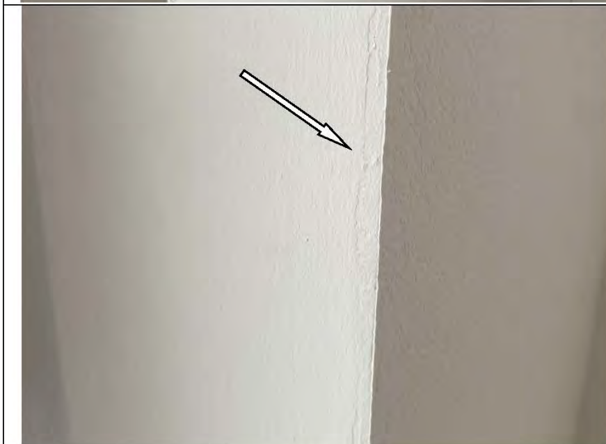
Фото №63. Окрашенные откосы оконного блока ПВХ выполнены с дефектами в кухне.
