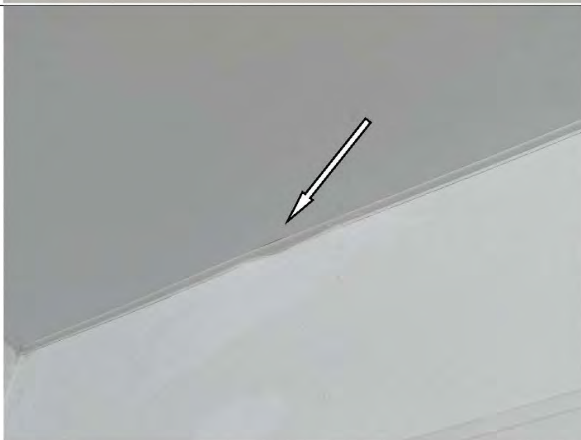
Фото №72. Дефект монтажа гибкой вставки крепления натяжного потолка в спальне.
