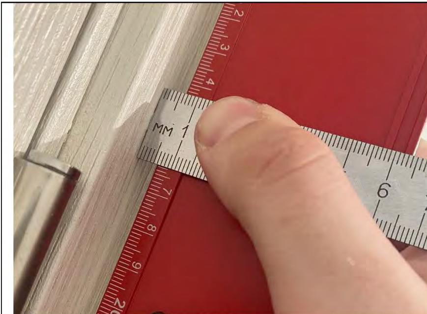
Фото №19. Отклонение наличников дверного блока равно 6 мм в санузле.
