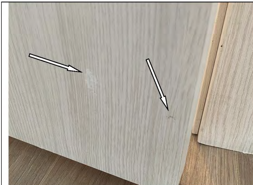
Фото №52. Лицевая поверхность деревянного дверного блока имеет загрязнения в спальне.
