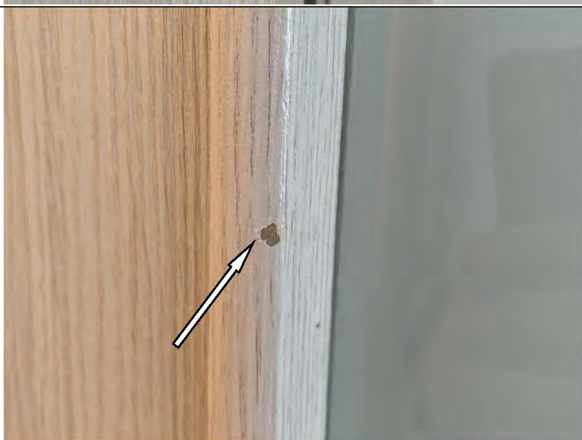
Фото №51. Дефект (скол) на лицевой поверхности полотна двери в кухне.
