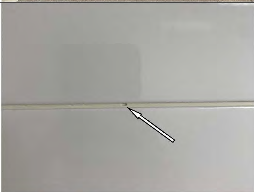
Фото №32. Затирка настенной плитки в санузле выполнена с нарушениями.
