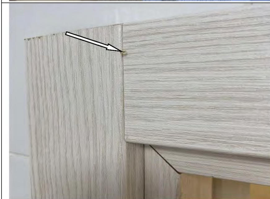
Фото №45. Наличник деревянного дверного блока имеет повреждения в санузле.
