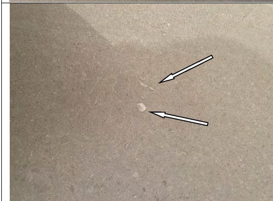
Фото №24. Загрязнения на поверхности напольной керамической плитки в коридоре.
