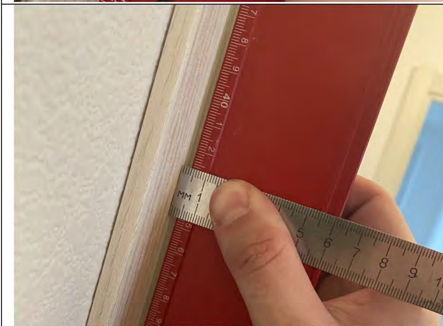
Фото №20. Отклонение наличников дверного блока равно 4 мм в ванной комнате.
