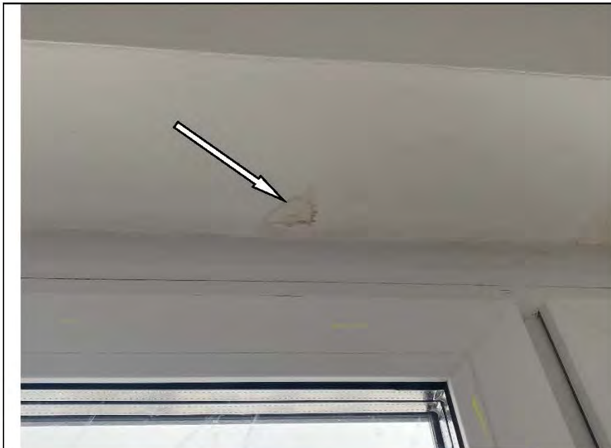
Фото №67. Откосы оконного блока ПВХ в кухне имеют следы залития в детской комнате.
