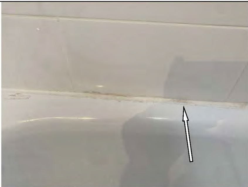
Фото №37. Ванная имеет дефекты (загрязнения).
