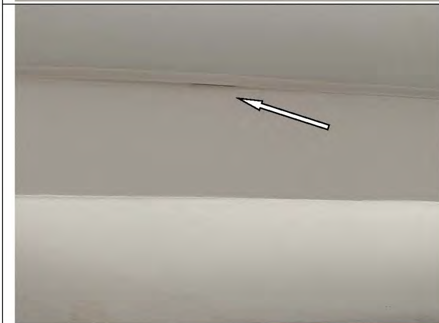
Фото №74. Дефект монтажа гибкой вставки крепления натяжного потолка в детской комнате.
