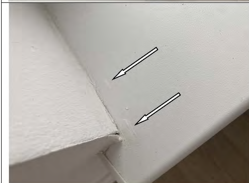
Фото №69. На лицевой поверхности подоконной доски в детской комнате имеются дефекты (загрязнения).
