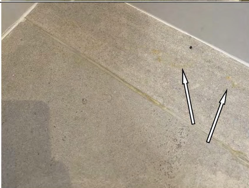
Фото №27. Загрязнения на поверхности напольной керамической плитки в ванной комнате.
