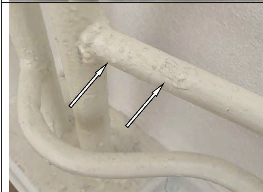
Фото №56. Окрашивание труб отопления выполнено с дефектами в спальне.
