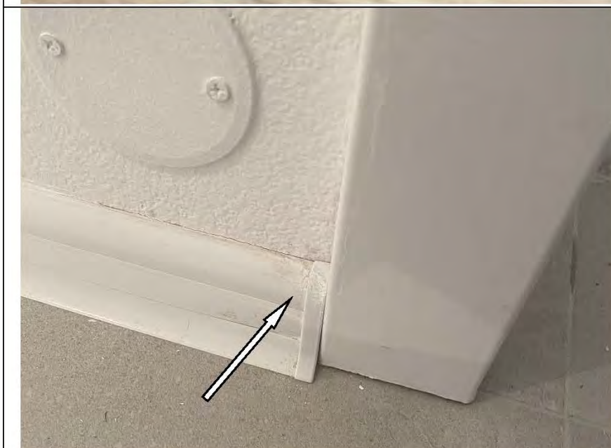
Фото №23. Загрязнение напольного плинтуса ПВХ в коридоре.
