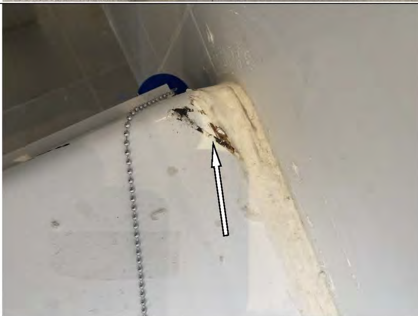
Фото №36. Ванная имеет дефекты (загрязнения).
