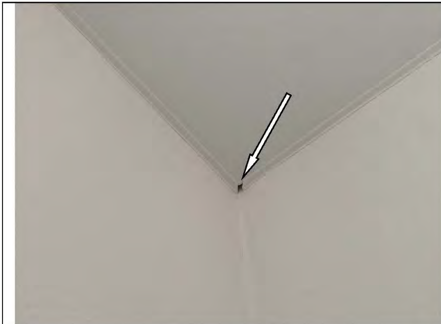
Фото №73. Дефект монтажа гибкой вставки крепления натяжного потолка в детской комнате.
