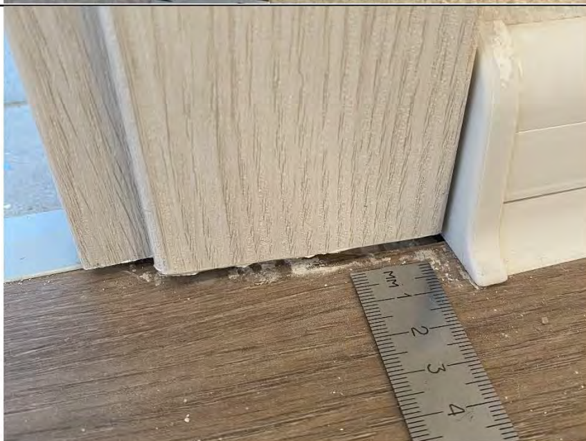
Фото №41. Между напольным покрытием и наличником деревянного дверного блока в коридоре имеется пространство.
