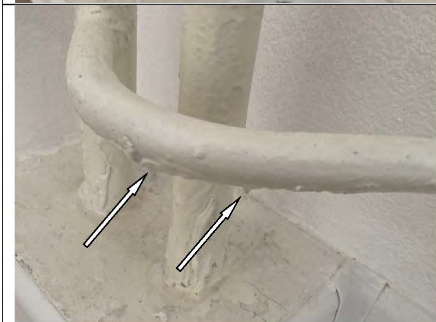
Фото №57. Окрашивание труб отопления выполнено с дефектами в спальне.
