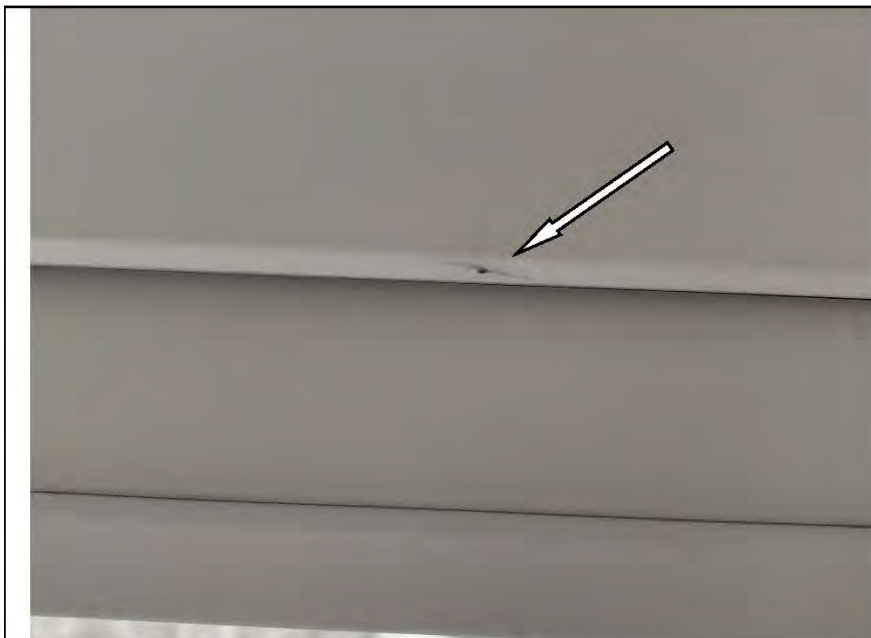
Фото №79. Загрязнения на профиле ПВХ оконного блока в детской комнате.
