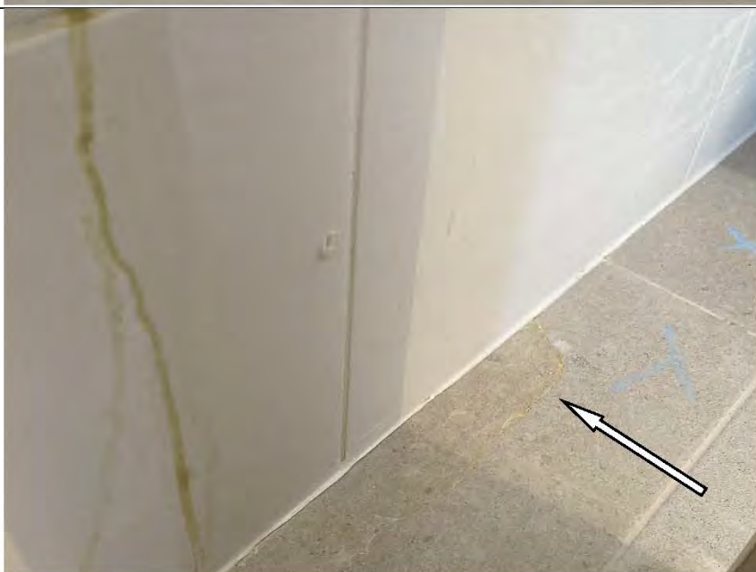
Фото №26. Загрязнения на поверхности напольной керамической плитки в ванной комнате.
