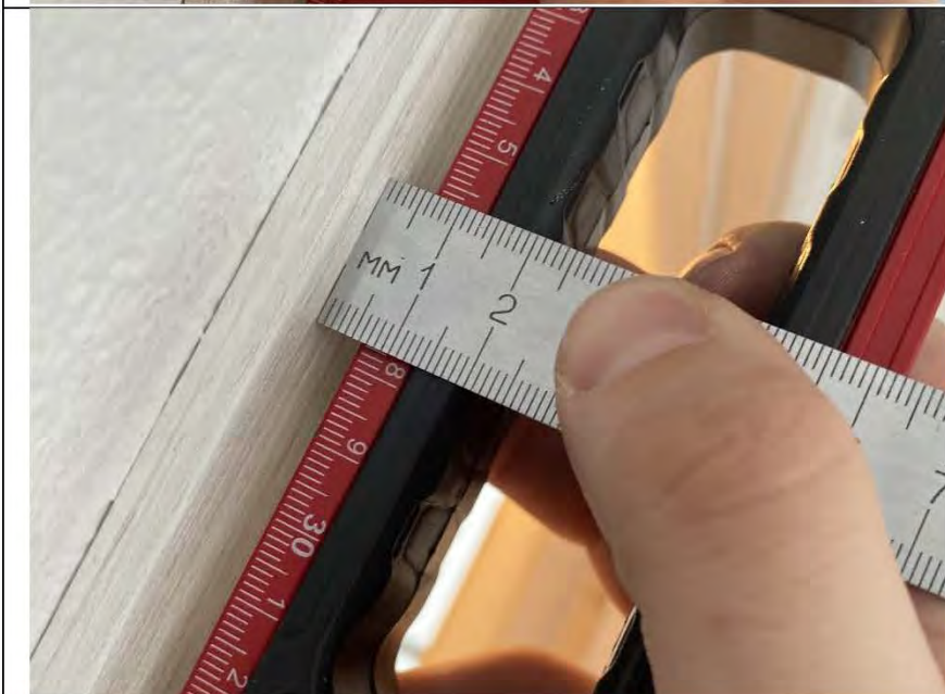
Фото №21. Отклонение наличников дверного блока равно 6 мм в кухне.
