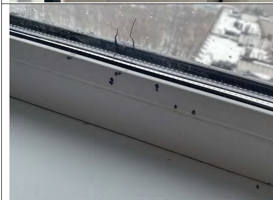
Фото №78. Загрязнения на профиле ПВХ оконного блока в детской комнате.
