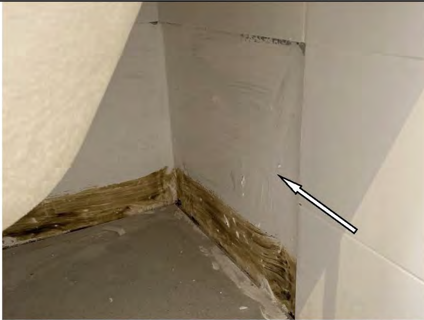
Фото №34. Частично отсутствует настенная керамическая плитка за ванной в ванной комнате.
