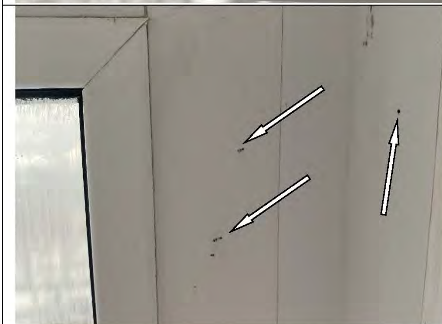
Фото №80. Загрязнения на профиле ПВХ оконного блока в детской комнате.
