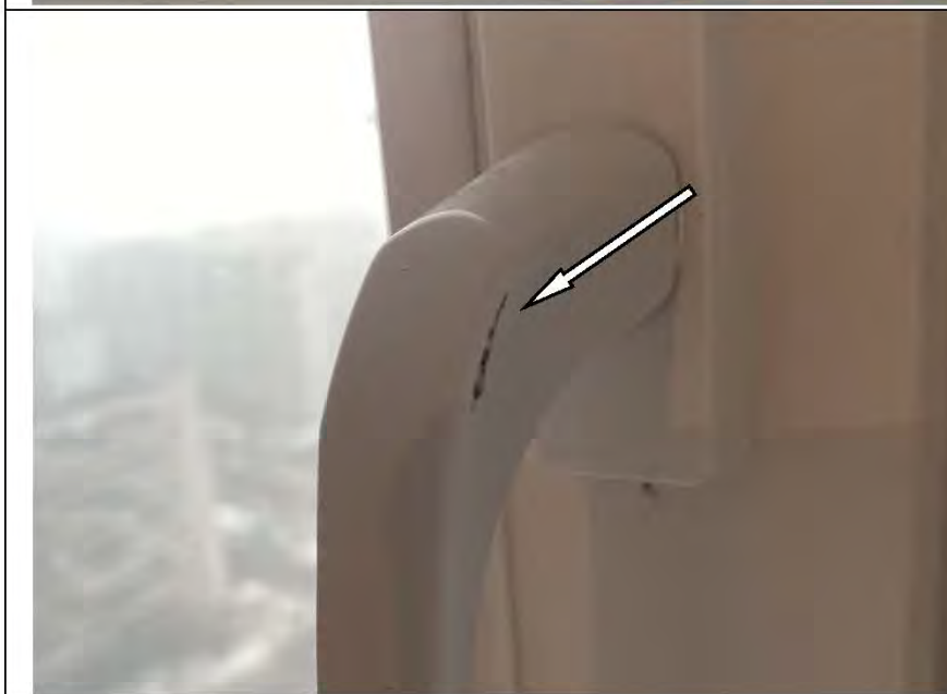
Фото №75. Царапины на фурнитуре оконного блока ПВХ (ручке) в спальне.
