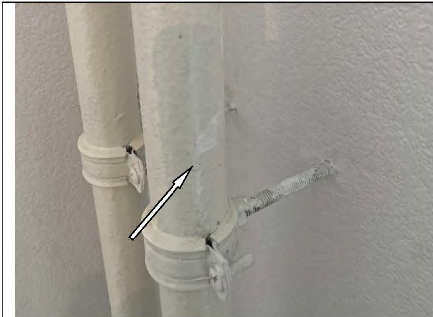
Фото №55. Окрашивание труб отопления выполнено с дефектами в спальне.
