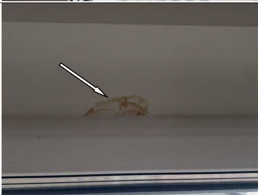
Фото №66. Откосы оконного блока ПВХ в кухне имеют следы залития в детской комнате.
