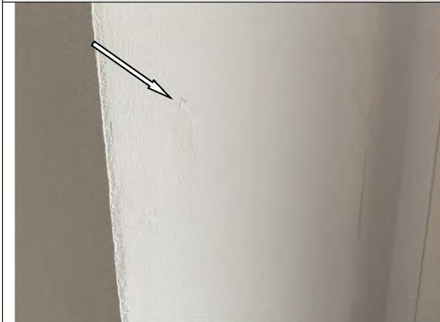
Фото №62. Окрашенные откосы оконного блока ПВХ выполнены с дефектами в кухне.
