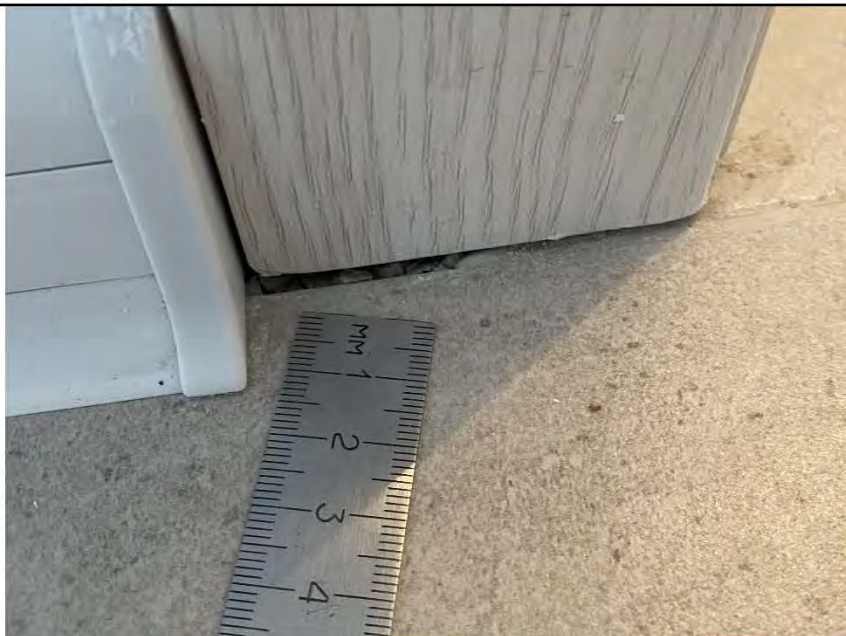
Фото №40. Коротко подрезана напольная керамическая плитка на стыке элементов в кухне.
