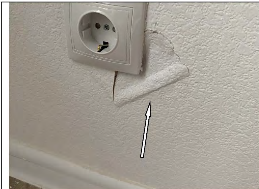
Фото №82. Стены, оклеенные обоями, в детской комнате выполнены с дефектами.
