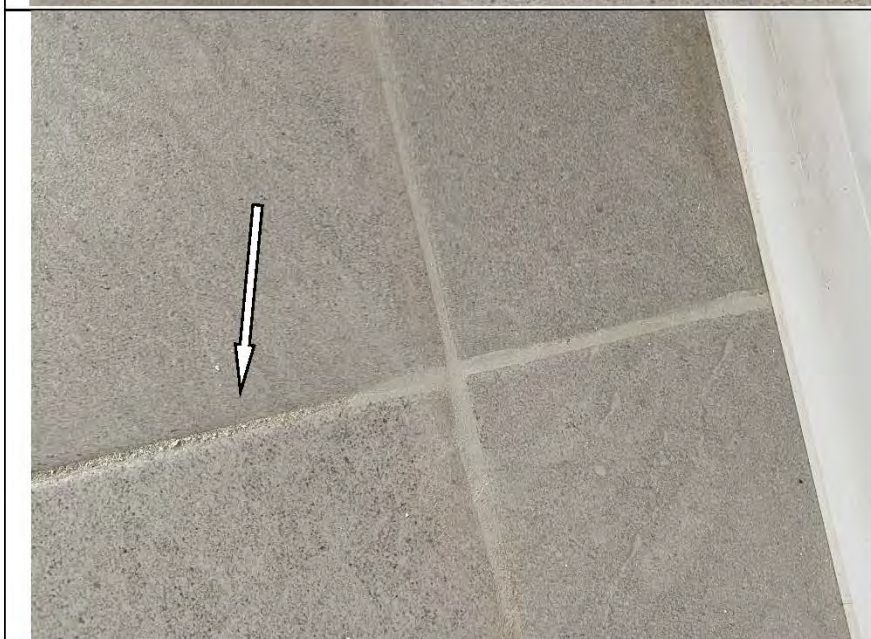
Фото №29. Затирка напольной плитки в кухне выполнена с нарушениями: неполное заполнение шовного пространства затирочным составом.
