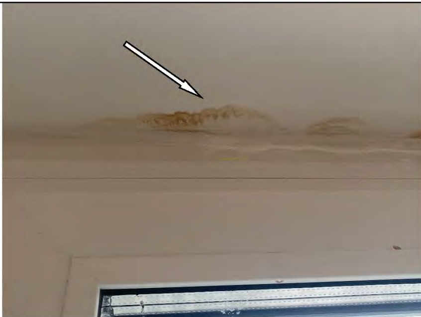
Фото №64. Откосы оконного блока ПВХ в кухне имеют следы залития в спальне.
