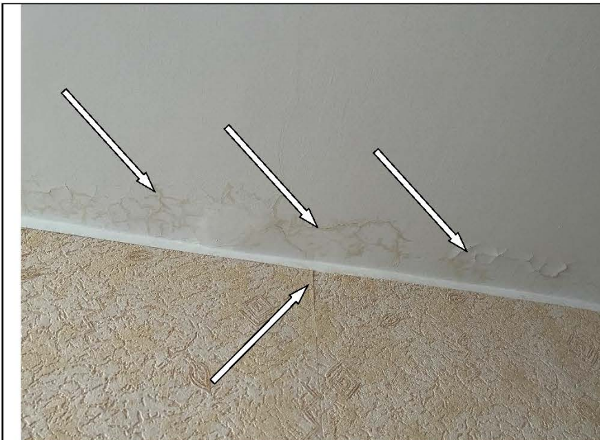
Фото №10. Стены, оклеенные обоями, в гостиной имеют дефекты характерные последствиям залива (отслоение). Отслоение краски, видимые следы заливки на поверхности потолка в гостиной.
