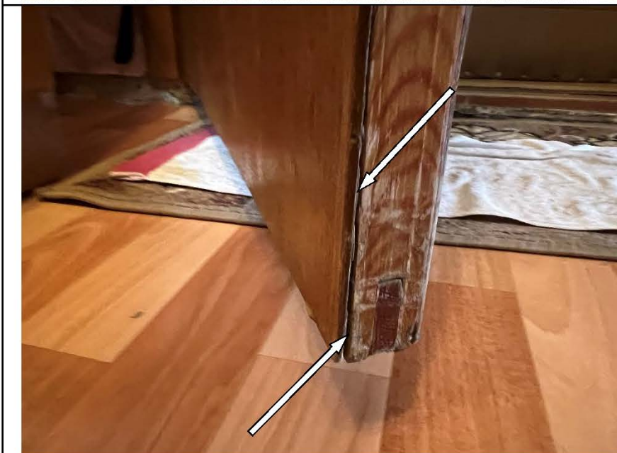
Фото №11. Деформация полотна входного дверного блока в следствии залива.
