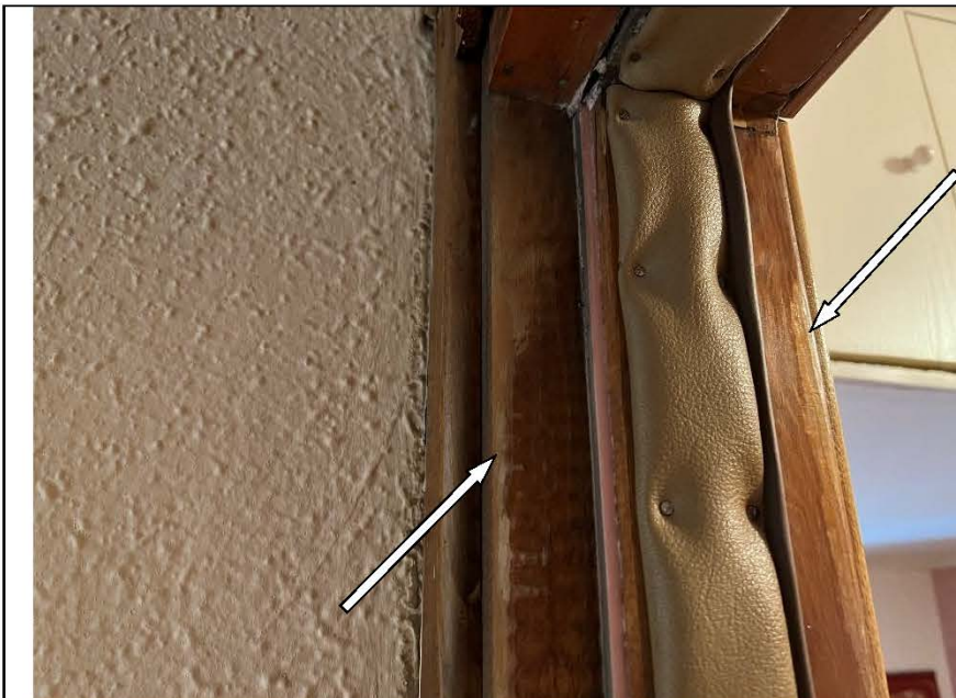
Фото №13. Деформация коробов входного дверного блока в следствии залива (разбухание)
