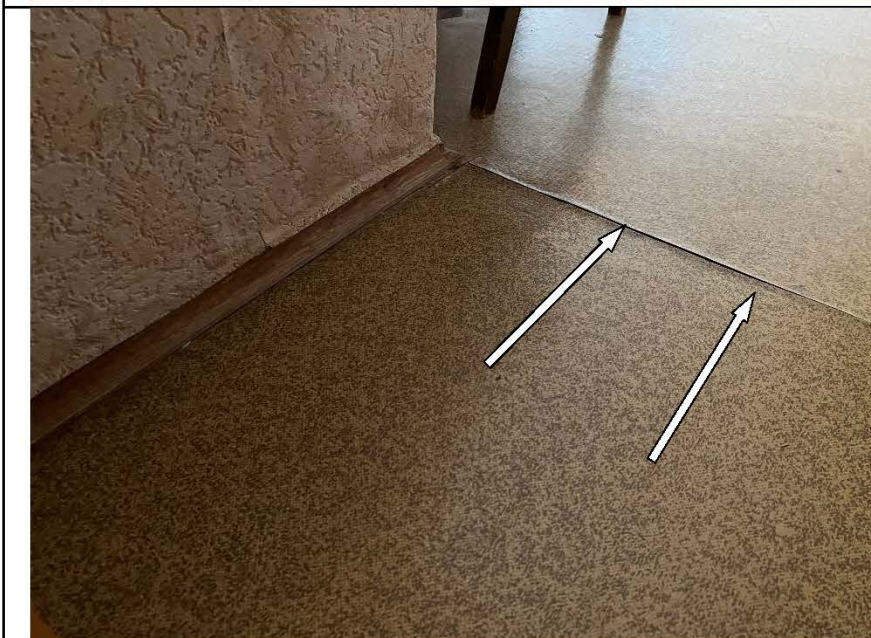
Фото №17. Вздутие линолеума в гостиной в следствии залива.
