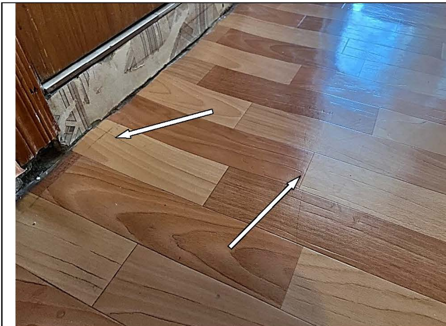
Фото №16. Вздутие линолеума в прихожей в следствии залива.
