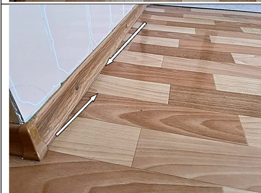
Фото №15. Вздутие линолеума в кухне в следствии залива.
