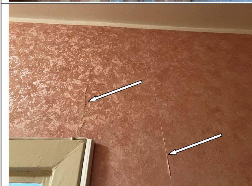
Фото №5. Стены, оклеенные обоями, в прихожей имеют дефекты характерные последствиям залива (отслоение).
