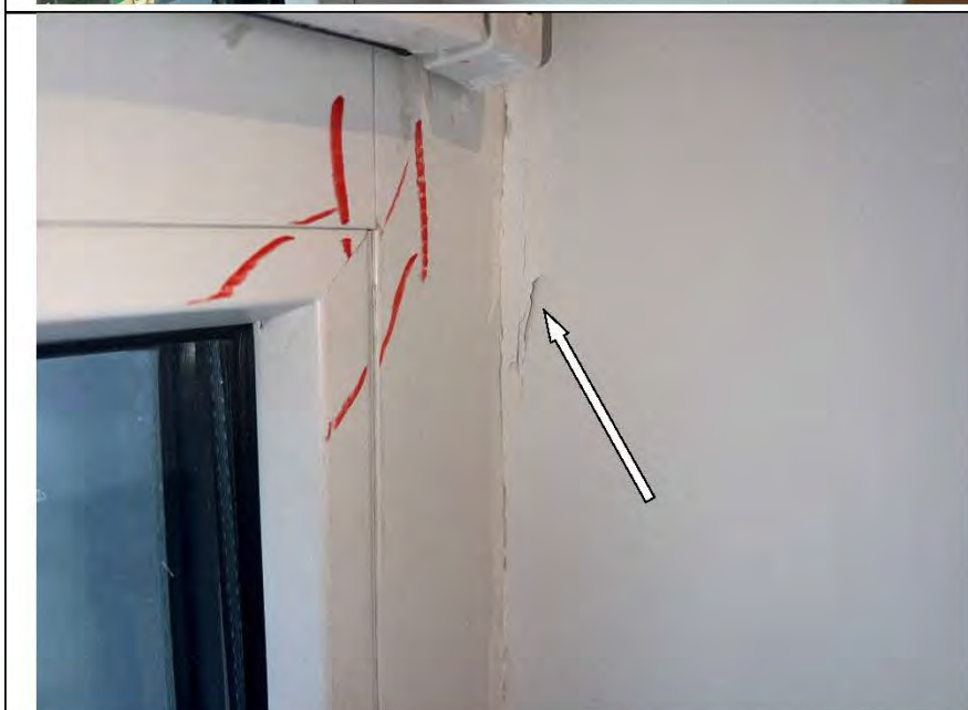
Фото №65. Трещина по отколу оконного блока ПВХ в гостиной.
