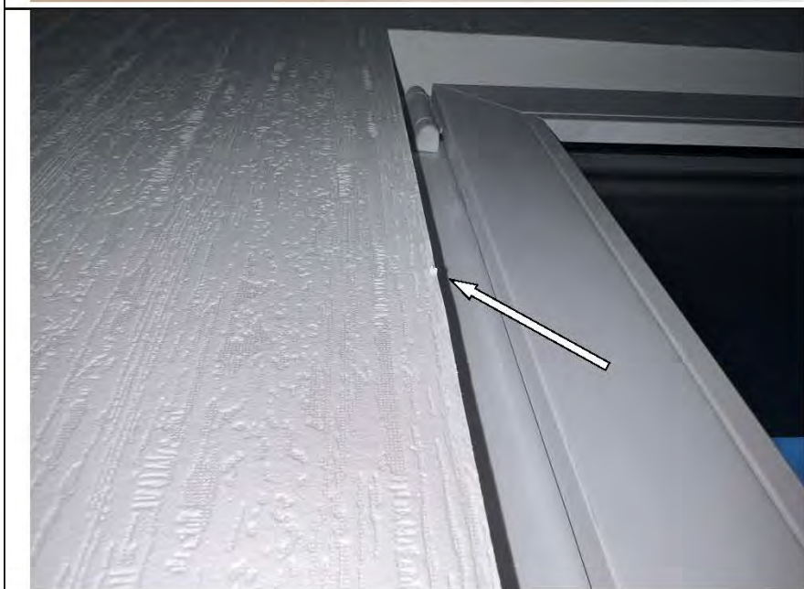
Фото №24. Скол обоевого полотна в спальне.
