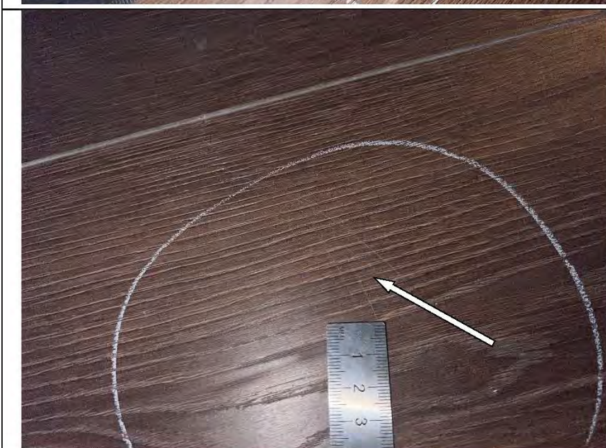
Фото №51. Царапина на поверхности ламината в спальне.
