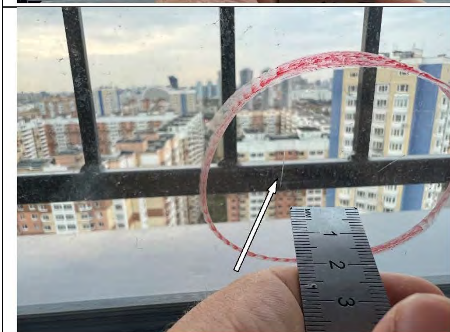
Фото №72. Царапина на стеклопакете оконного блока ПВХ в кухне.
