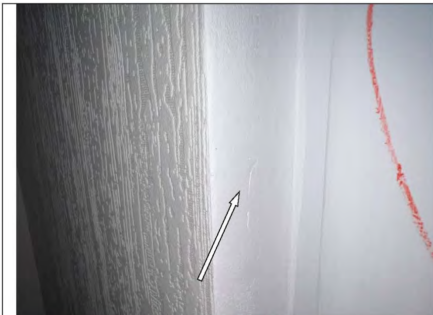
Фото №70. Подтеки краски на откосах оконного блока ПВХ в кабинете.
