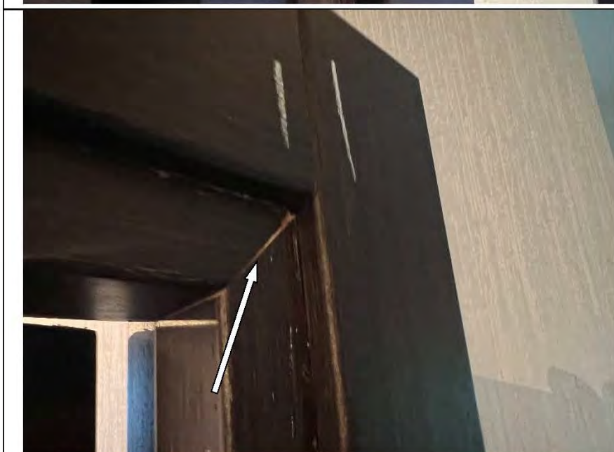
Фото №119. Элементы дверного блока соединены не надежно в детской.
