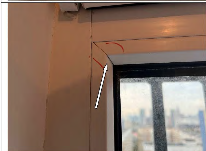
Фото №81. Зазоры в стыках профиля ПВХ оконного блока в кухне.
