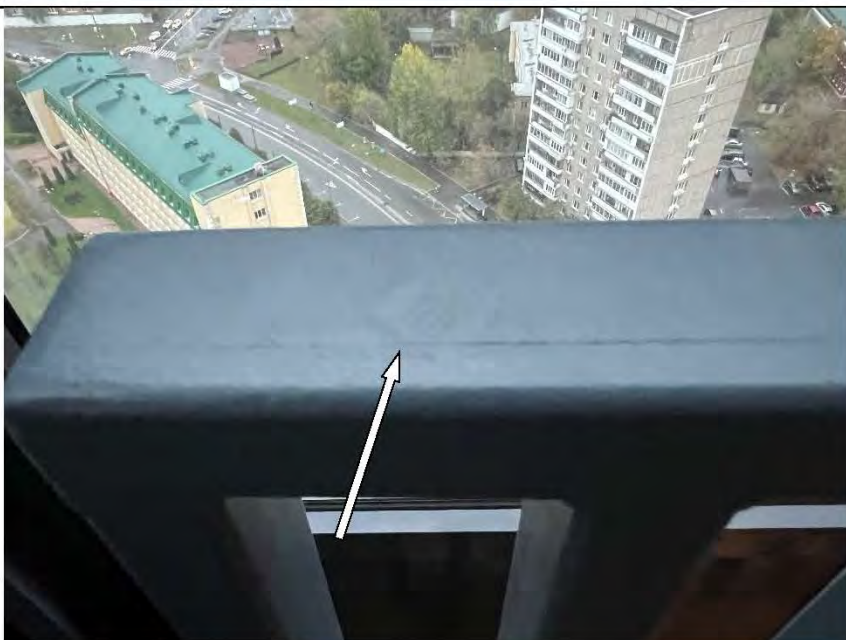
Фото №113. Царапины на металлическом профиле ограждения лоджии.
