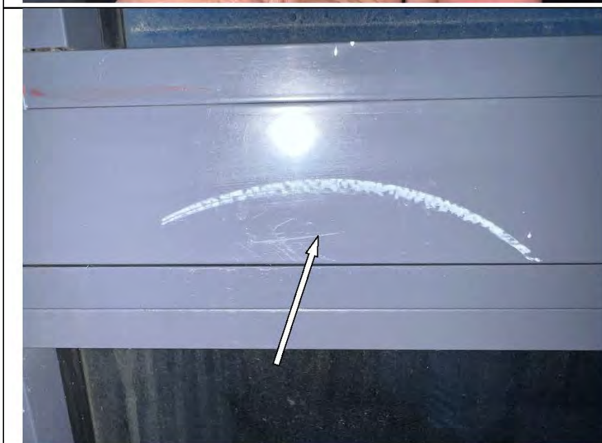
Фото №111. Царапины на металлическом профиле оконного блока на лоджии.
