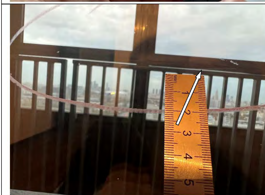
Фото №77. Царапина на стеклопакете оконного блока ПВХ в кабинете.
