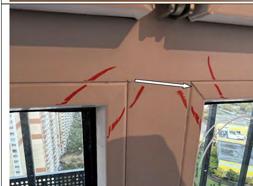
Фото №84. Зазоры в стыках профиля ПВХ оконного блока в гостиной.
