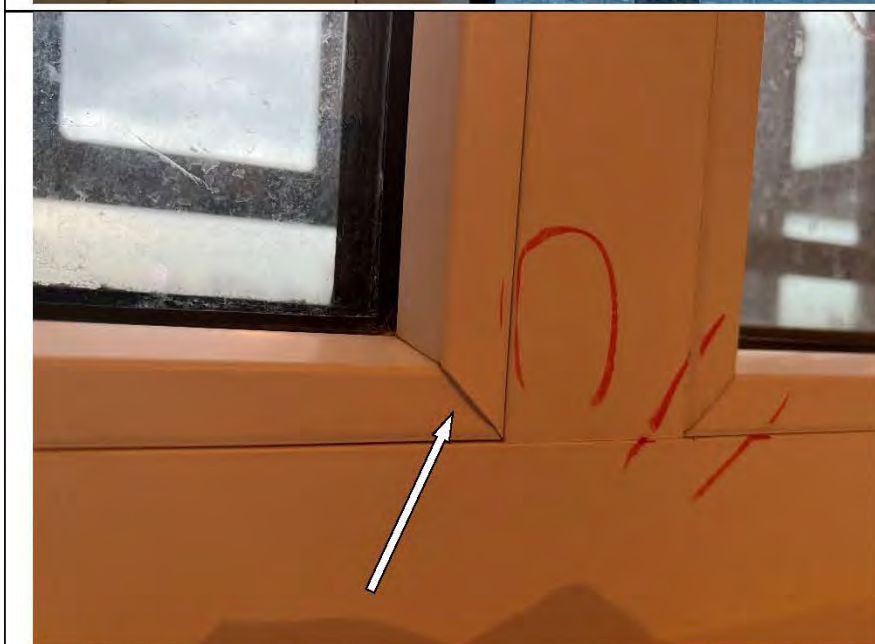
Фото №92. Зазоры в стыках профиля ПВХ оконного блока в детской.
