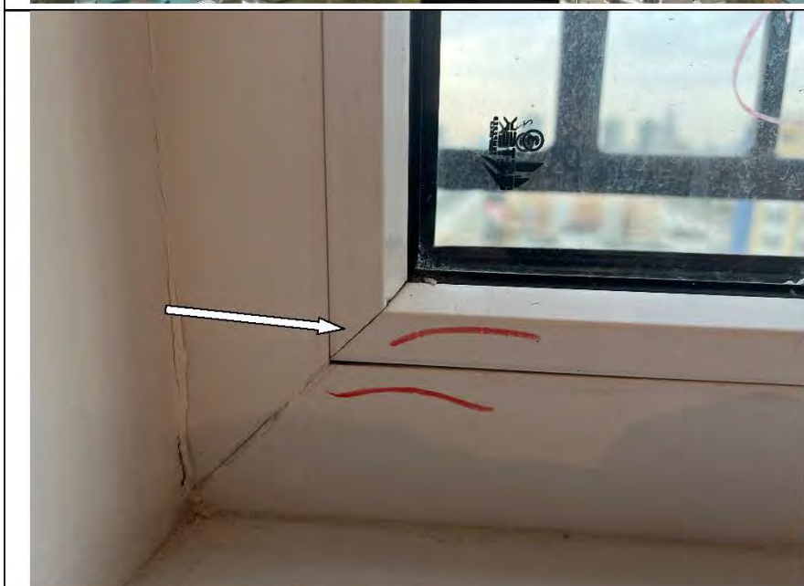
Фото №80. Зазоры в стыках профиля ПВХ оконного блока в кухне.
