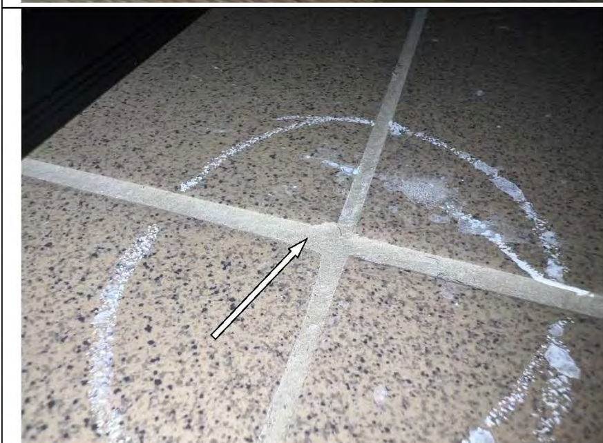
Фото №59. Скол напольной керамической плитки на лоджии.
