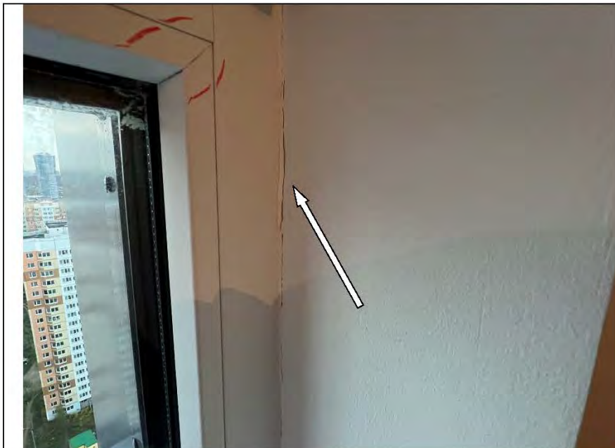
Фото №64. Трещина по отколу оконного блока ПВХ в кухне.
