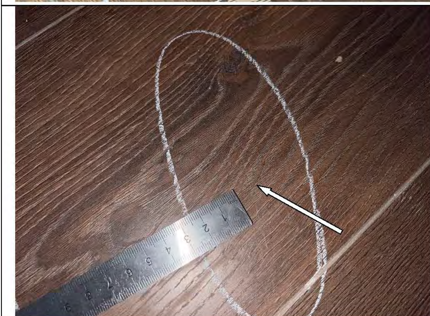
Фото №50. Царапина на поверхности ламината в спальне.
