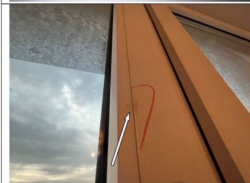
Фото №96. Царапина на профиле ПВХ оконного блока в кухне.
