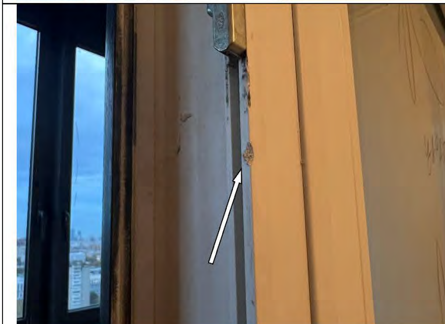
Фото №104. Скол коробки дверного блока ПВХ на лоджию.
