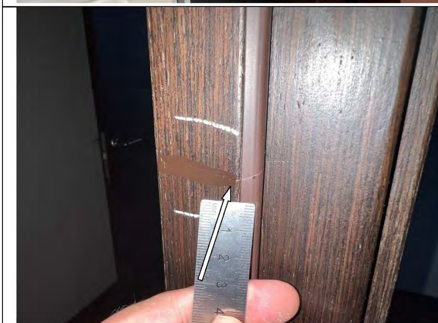
Фото №126. Царапины на коробе деревянного дверного блока в спальне.
