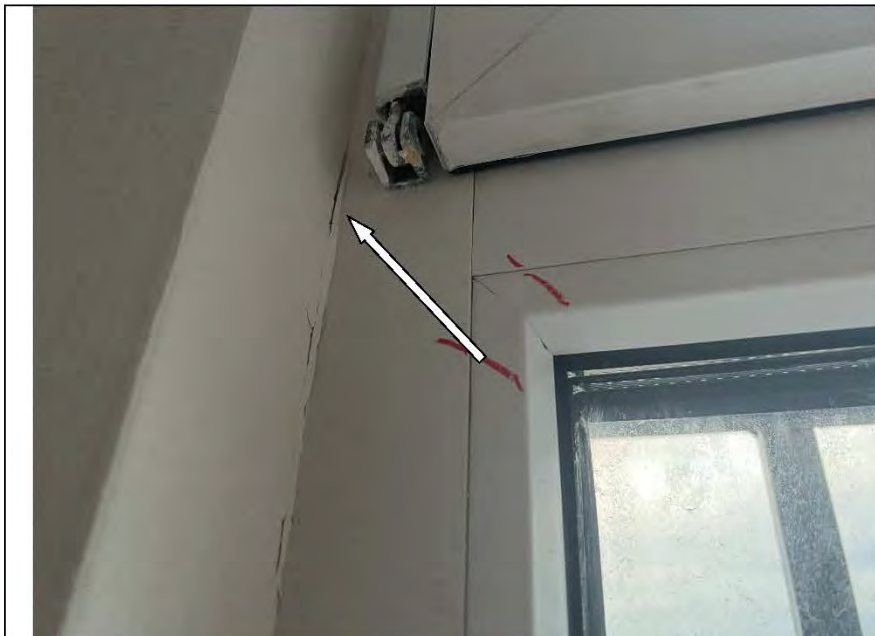
Фото №67. Трещина по откошу оконного блока ПВХ в спальне.
