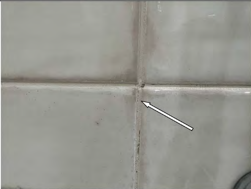
Фото №33. Трещина затирочного раствора в шовном пространстве настенной керамической плитки в ванной комнате.
