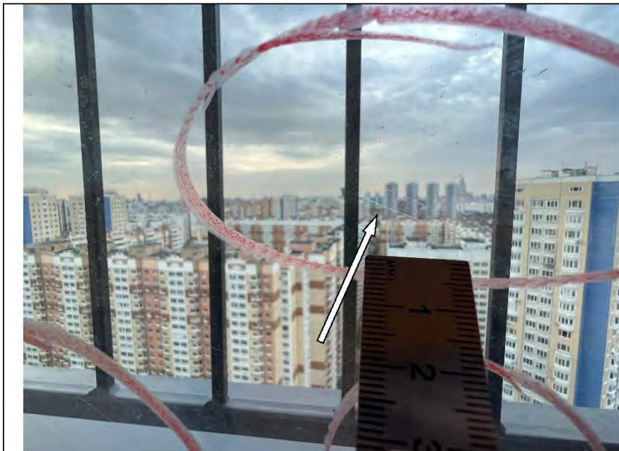
Фото №73. Царапина на стеклопакете оконного блока ПВХ в кухне.
