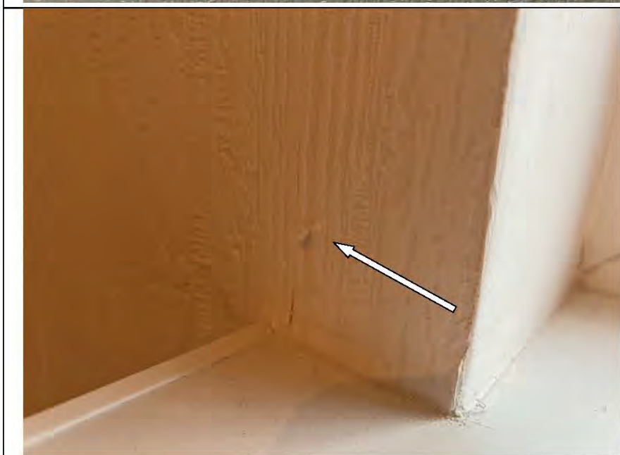
Фото №23. Скол обоевого полотна в кухне.
