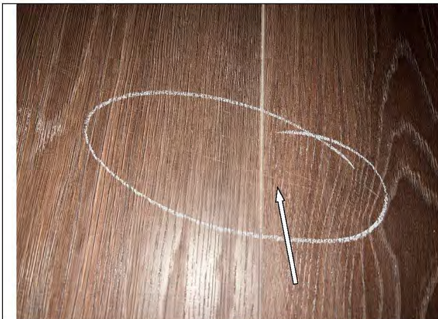
Фото №52. Царапина на поверхности ламината в спальне.
