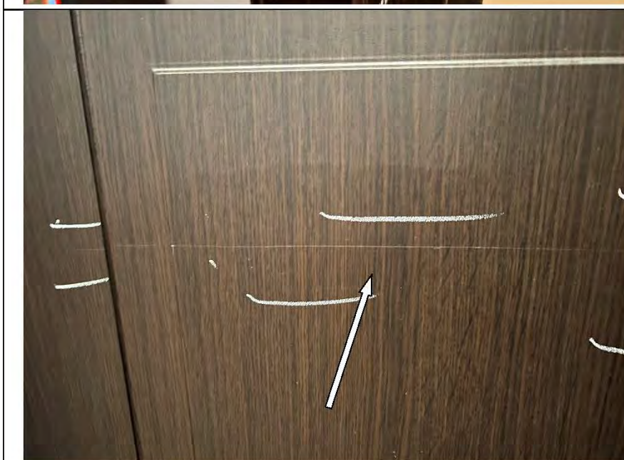
Фото №129. Царапины на полотне входного дверного блока.
