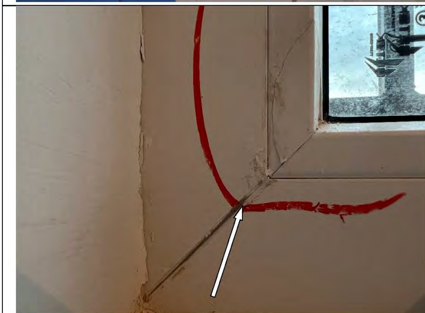
Фото №102. Трещина на профиле ПВХ оконного блока в гостиной.
