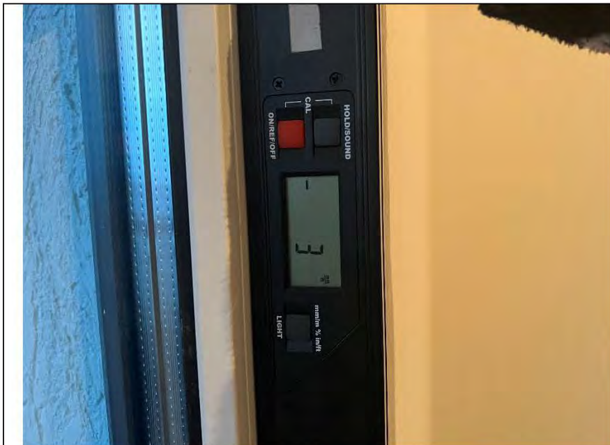
Фото №103. Отклонение оконного блока ПВХ в кабинете по уровню вертикальности составляет 3 мм.
