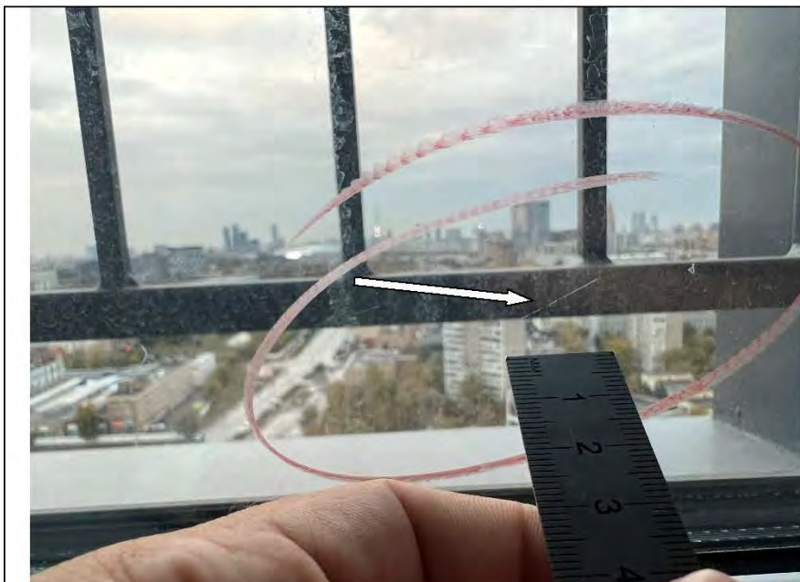
Фото №76. Царапина на стеклопакете оконного блока ПВХ в спальне.
