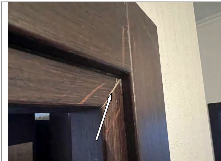
Фото №118. Элементы дверного блока соединены не надежно в кухне.
