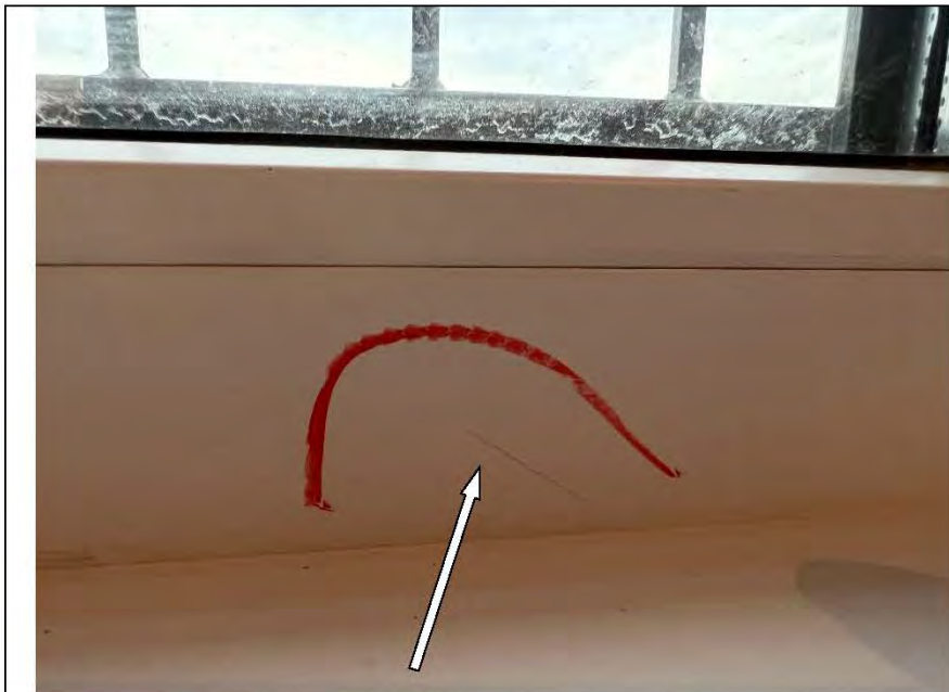
Фото №97. Царапина на профиле ПВХ оконного блока в гостиной.
