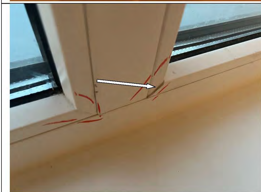
Фото №93. Зазоры в стыках профиля ПВХ оконного блока в детской.
