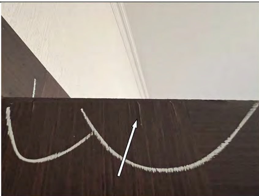
Фото №114. Отслоение ламинации на полотне деревянного дверного блока в гардеробной.
