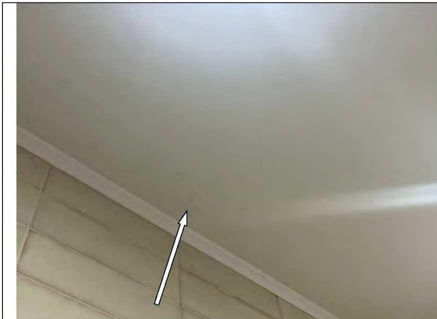
Фото №109. Загрязнение поверхности потолка в ванной комнате.
