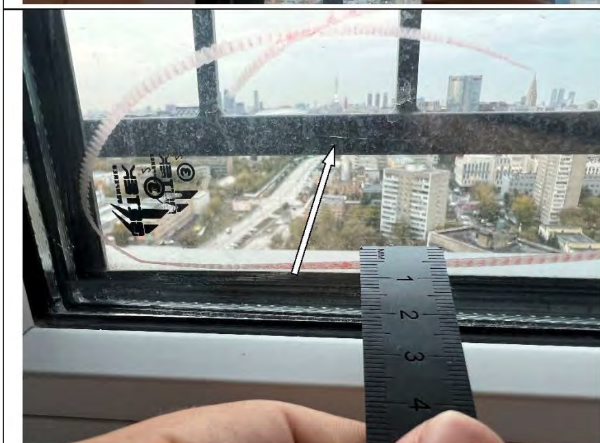
Фото №75. Царапина на стеклопакете оконного блока ПВХ в спальне.
