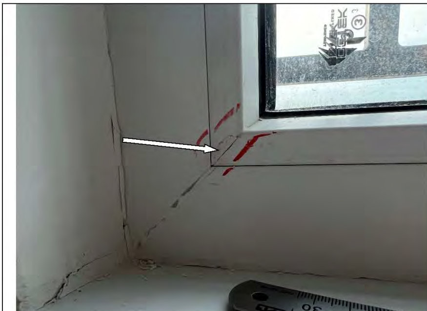
Фото №88. Зазоры в стыках профиля ПВХ оконного блока в спальне.
