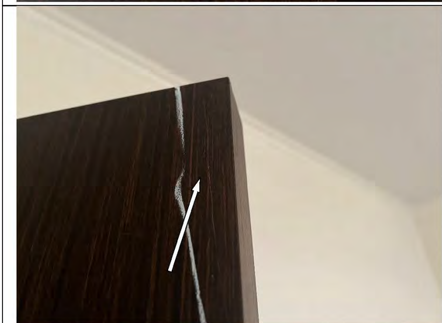
Фото №116. Царапины на полотне деревянного дверного блока в спальне.
