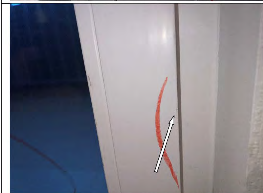
Фото №101. Царапина на профиле ПВХ оконного блока в кабинете.
