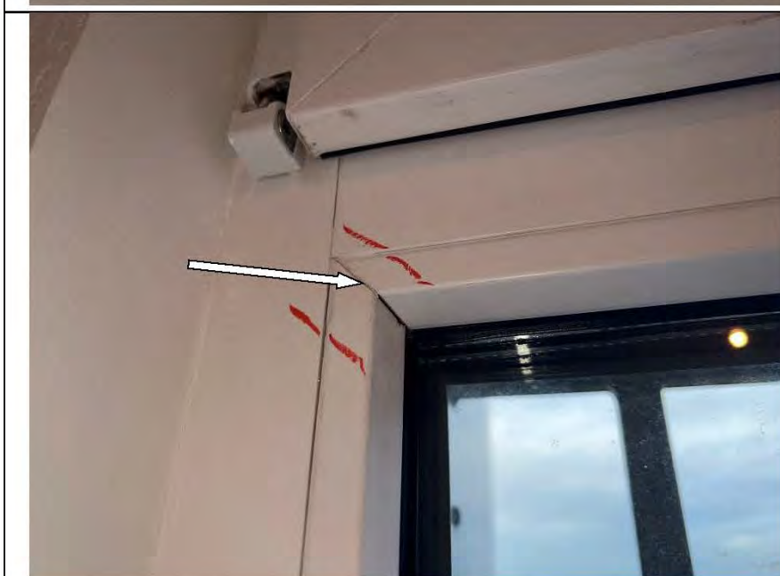
Фото №87. Зазоры в стыках профиля ПВХ оконного блока в гостиной.
