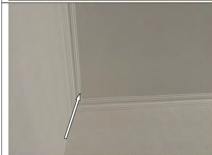
Фото №108. Загрязнение поверхности потолка в кабинете.
