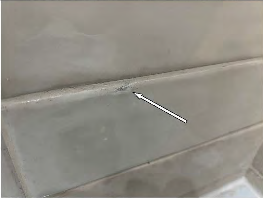
Фото №31. Скол настенной керамической плитки в санузле.
