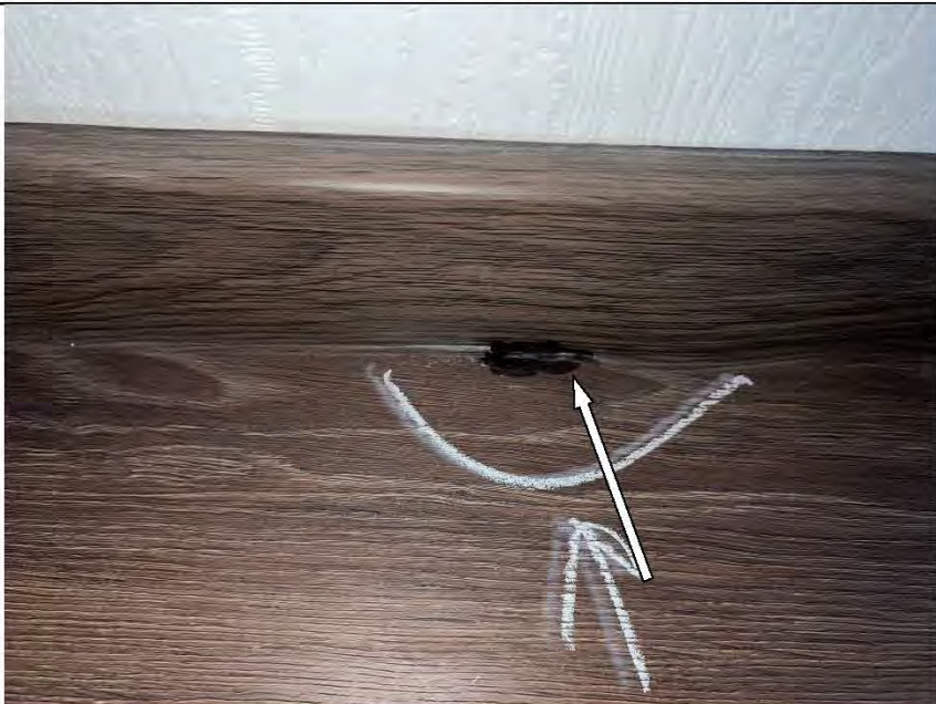
Фото №47. Коротко подрезан ламинат в спальне на стыке элементов.
