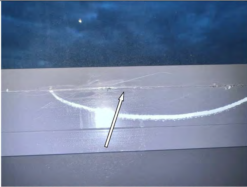
Фото №112. Царапины на металлическом профиле оконного блока на лоджии.
