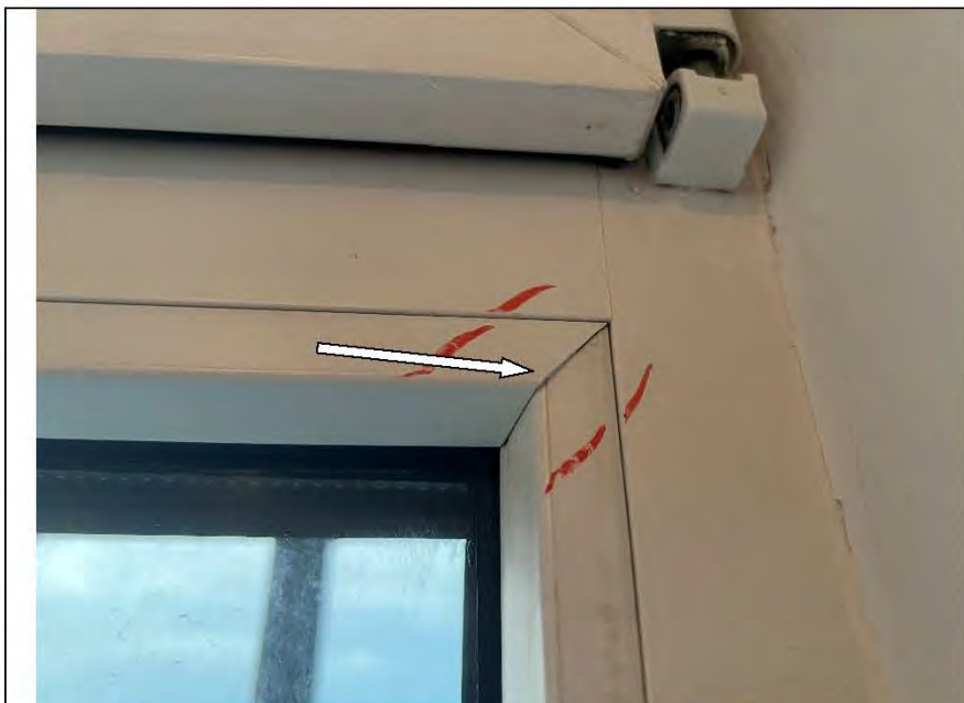
Фото №85. Зазоры в стыках профиля ПВХ оконного блока в гостиной.
