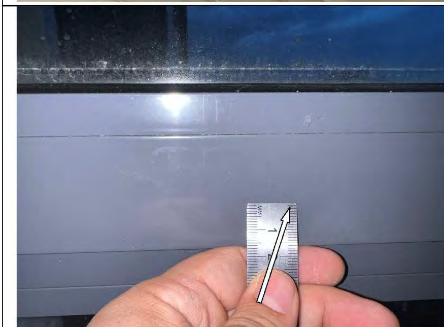
Фото №110. Царапины на металлическом профиле оконного блока на лоджии.
