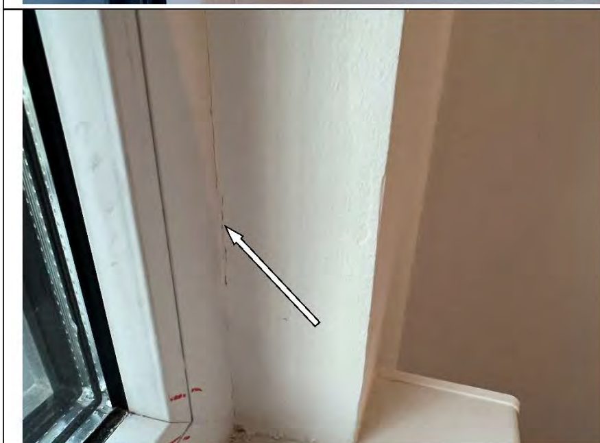
Фото №66. Трещина по отколу оконного блока ПВХ в гостиной.
