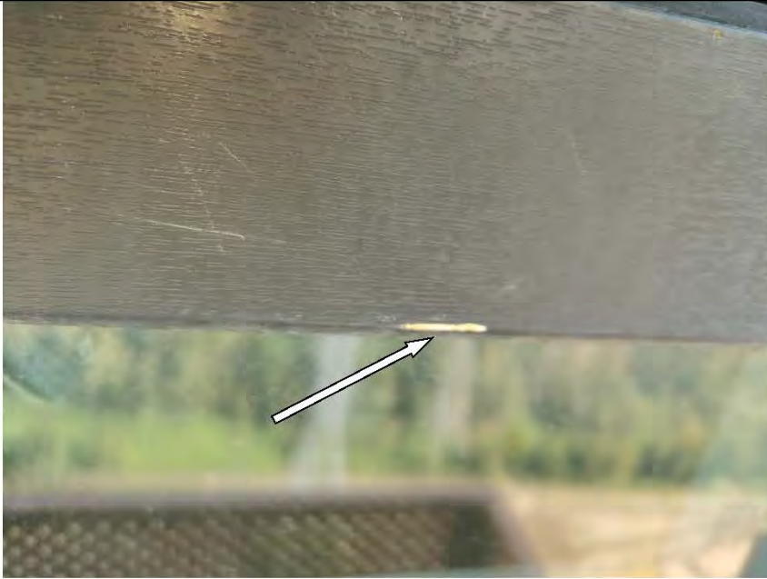
Фото №25. Потертости на профиле ПВХ оконного блока в спальне.
