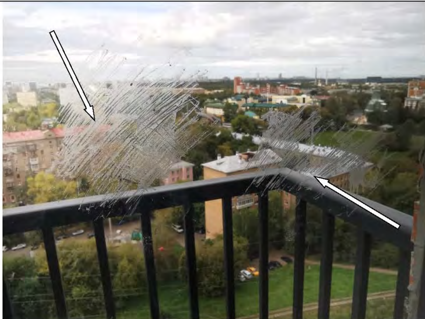
Фото №19. Загрязнение стеклопакета оконного блока ПВХ в кухне.
