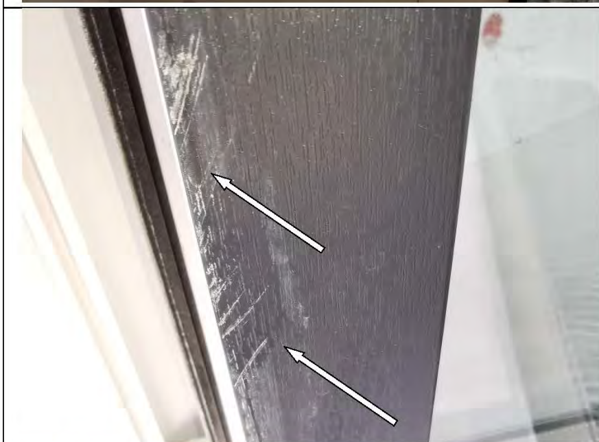
Фото №23. Царапины на профиле ПВХ дверного блока в кухне.
