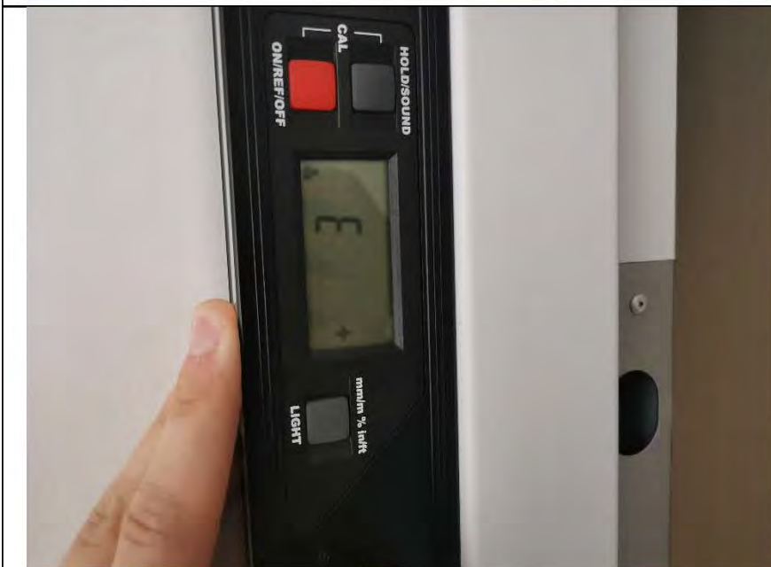
Фото №29. Отклонение короба входного дверного блока.
