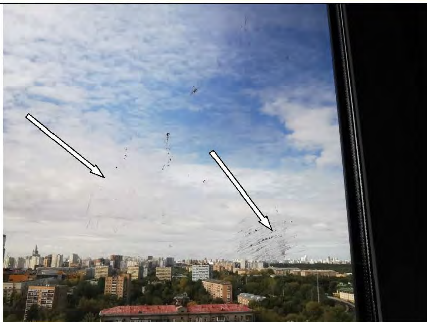
Фото №21. Загрязнение стеклопакета оконного блока ПВХ в спальне.
