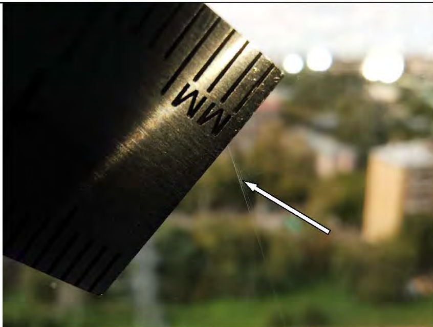
Фото №20. Царапины на стеклопакете оконного блока ПВХ в спальне.
