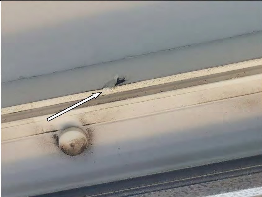
Фото №26. Скол на профиле ПВХ оконного блока в спальне.
