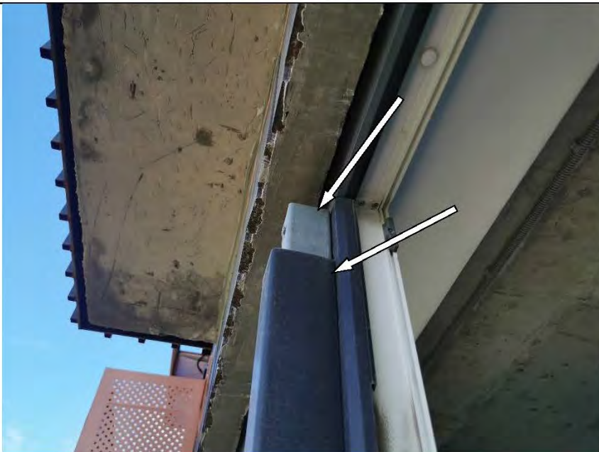
Фото №27. Коротко подрезан декоративный элемент ПВХ оконного блока в спальне.
