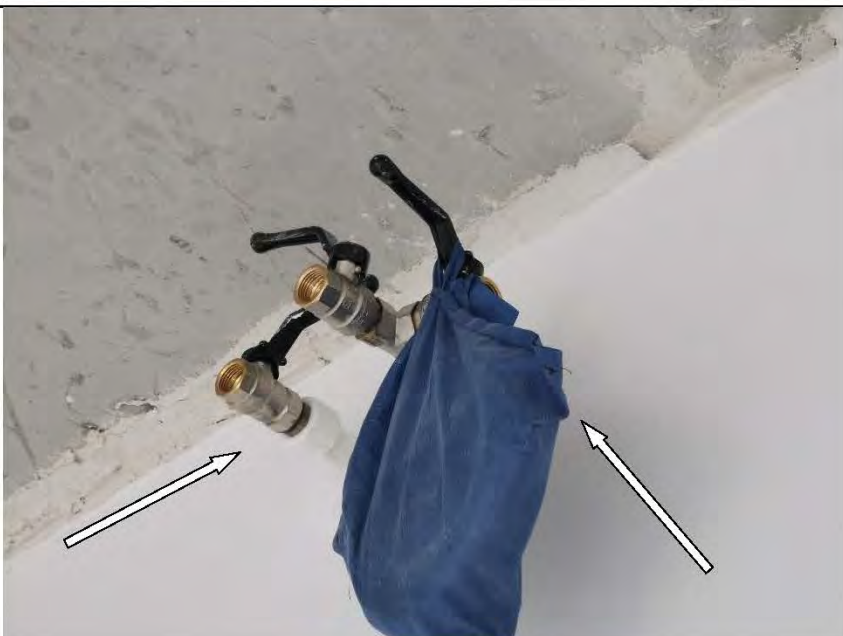
Фото №36. Место вывода труб водоснабжения (возможно расхождение с проектом).
