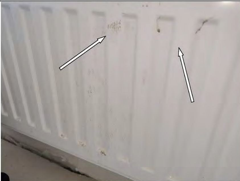
Фото №35. Потертости на радиаторе в спальне.
