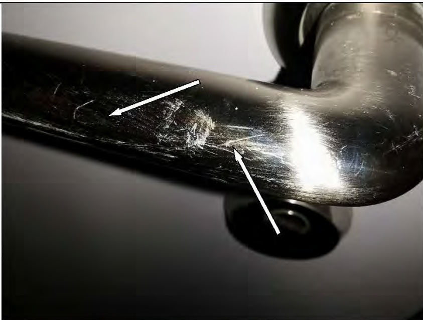
Фото №32. Царапины на фурнитуре входного дверного блока.
