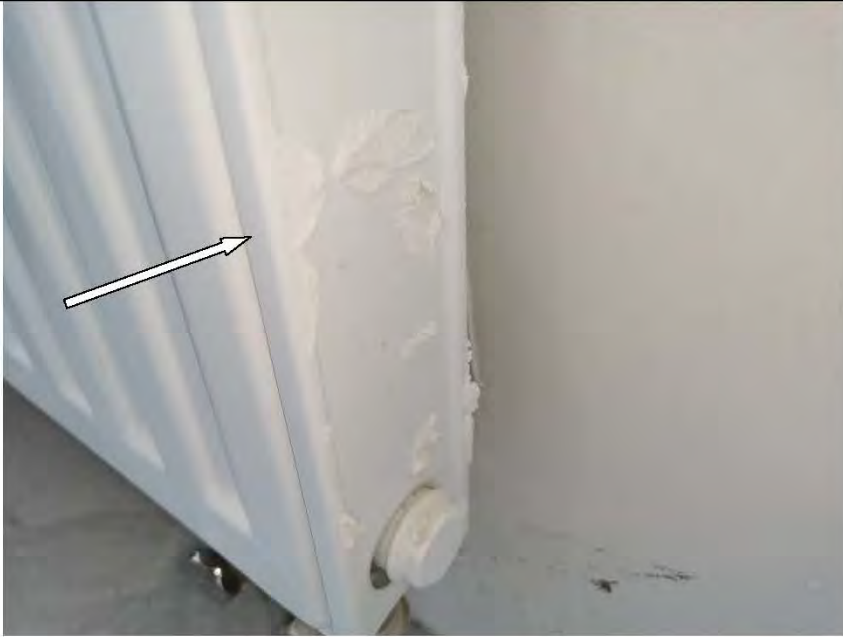
Фото №34. Загрязнение радиатора в спальне.
