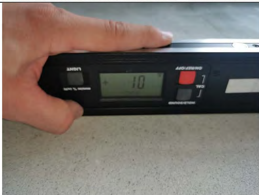
Фото №15. Измерение уровня пола в спальне.
