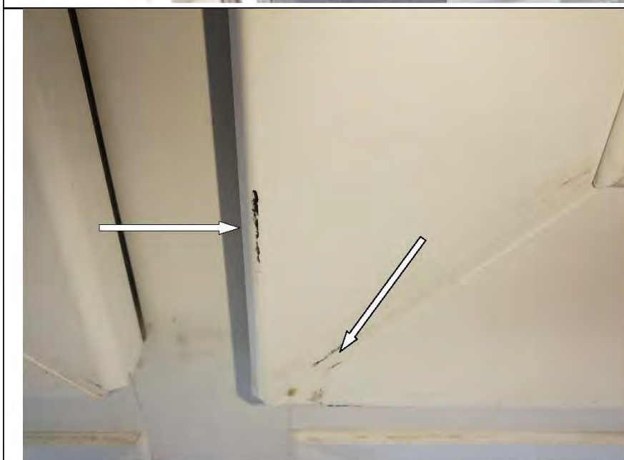
Фото №24. Потертости на профиле ПВХ оконного блока в спальне.
