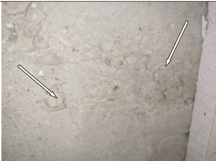
Фото №13. Отсутствие однородности внешнего вида поверхности железобетонного пилона в санузле.
