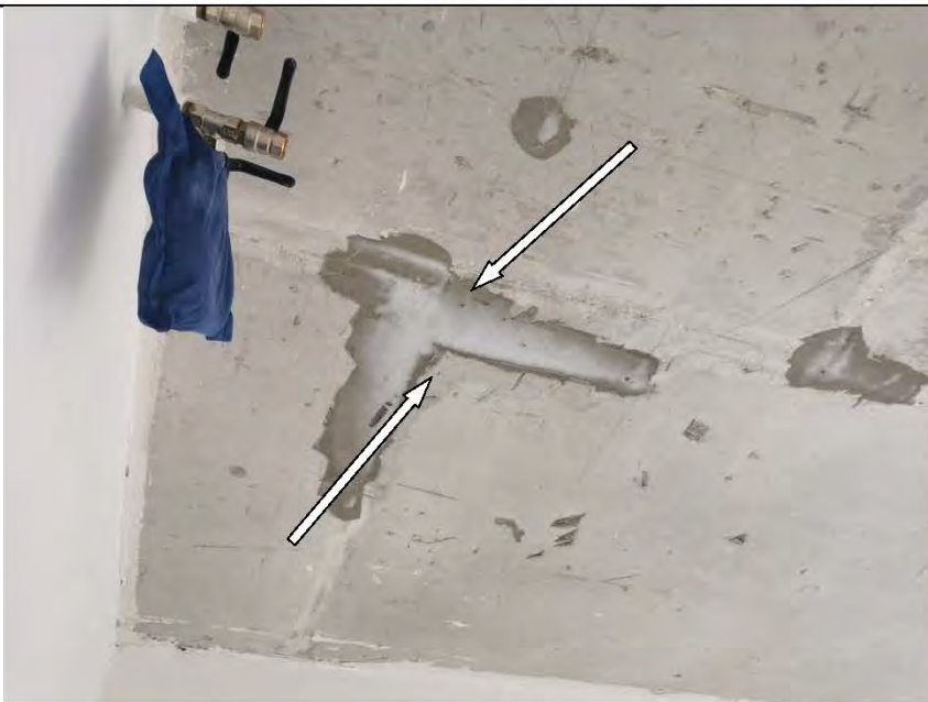
Фото №17. Просадка уровня железобетонных плит перекрытия в спальне.
