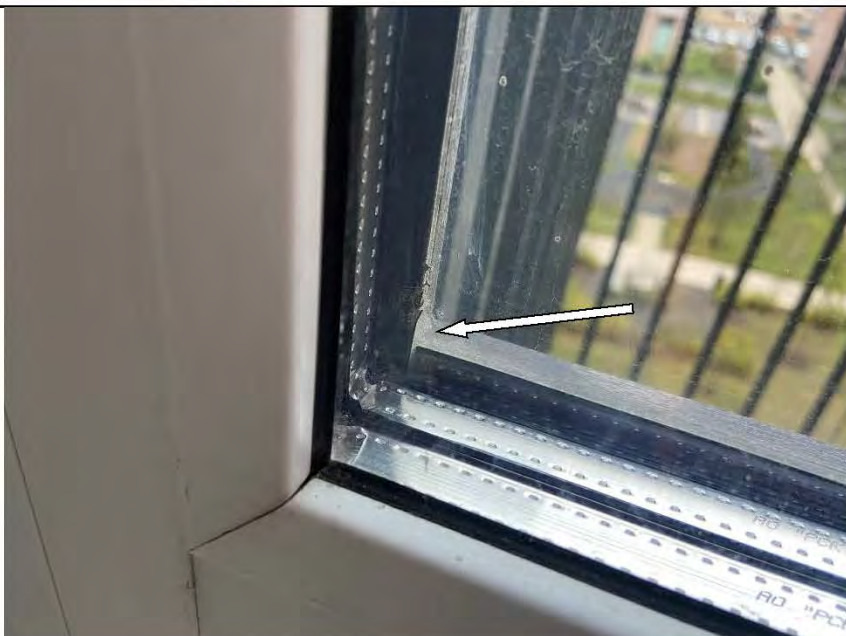
Фото №48. Дефект на уплотнительной ленте оконного блока ПВХ в спальне.
