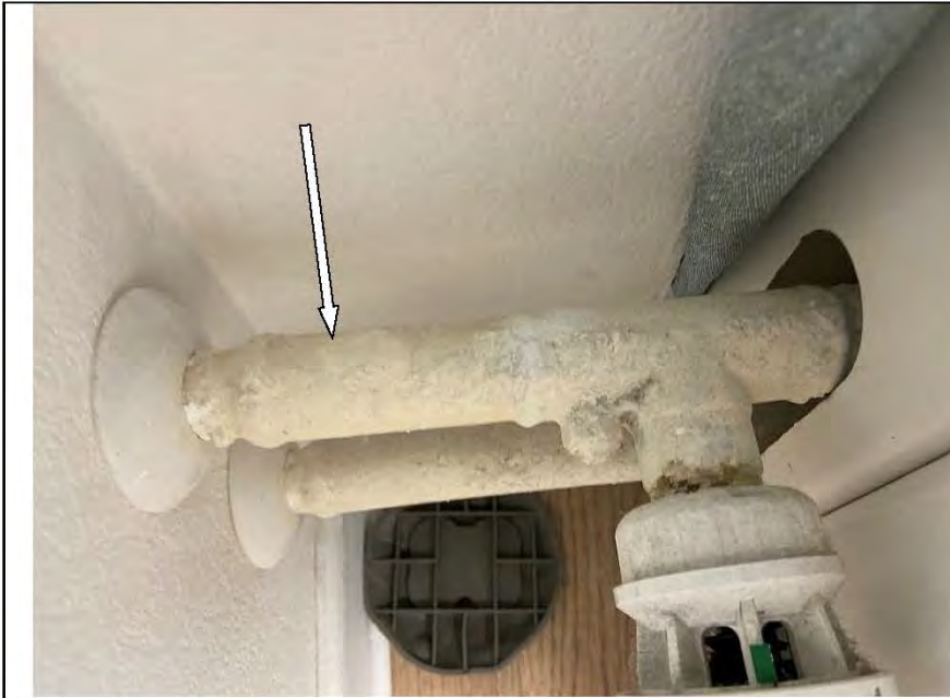
Фото №46. Неровности, подтеки на окрашенных трубах отопления в спальне.
