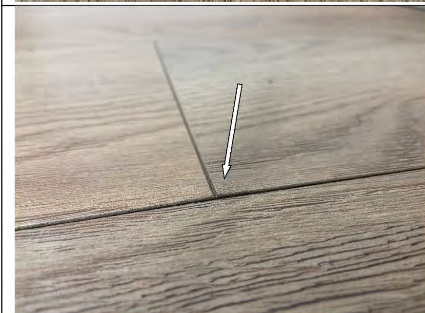
Фото №32. Поднятые кромки досок ламината в спальне.
