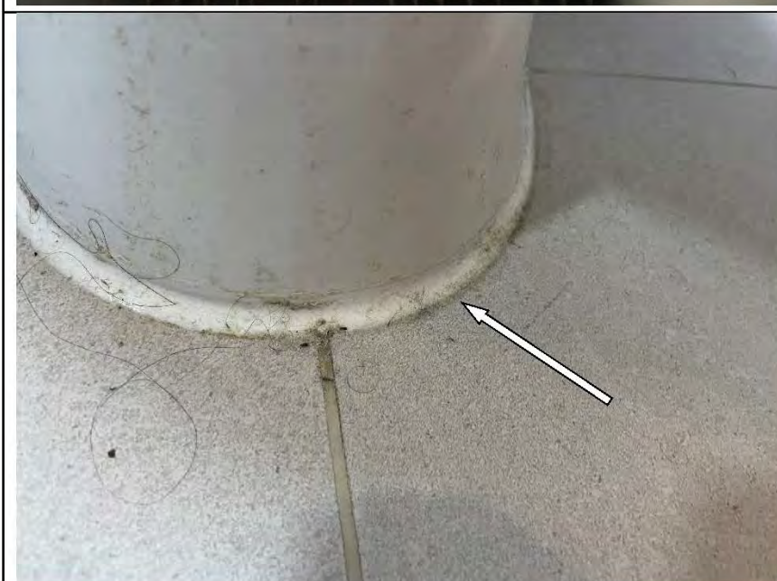
Фото №66. Загрязнения на унитазе в ванной комнате.
