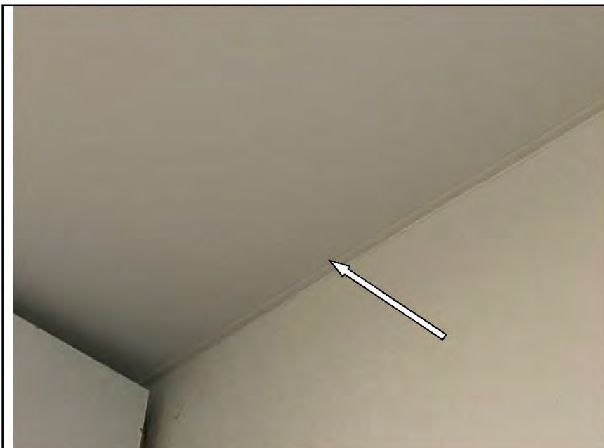
Фото №61. Дефект на поверхности натяжного потолка в кухне.
