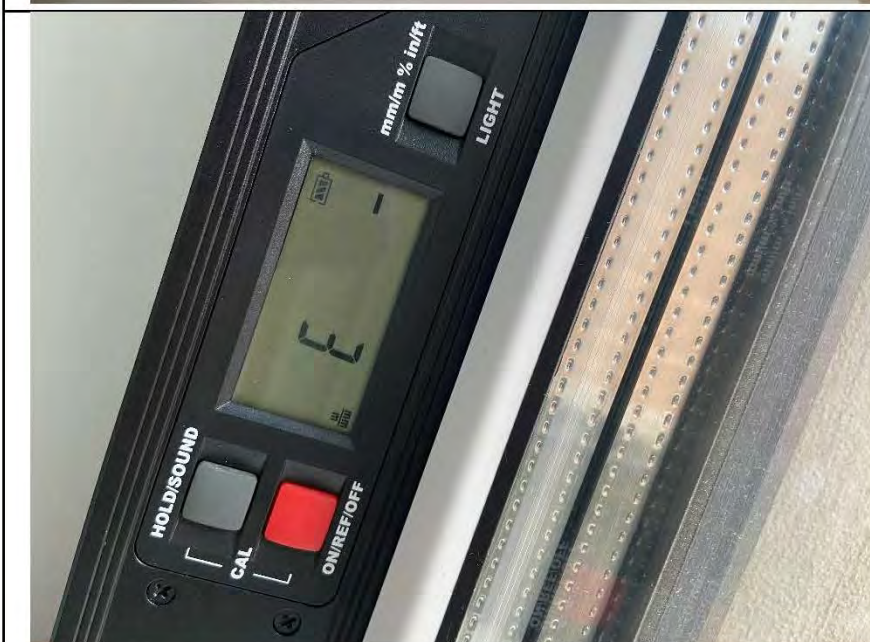
Фото №44. Отклонения от вертикали оконного блока ПВХ в спальне.
