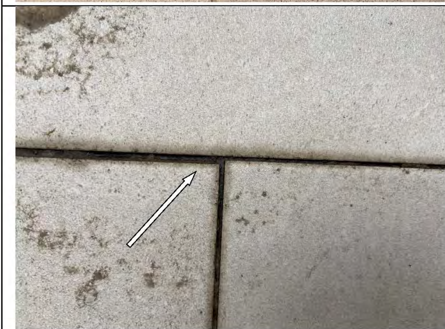
Фото №24. Неровные швы напольной керамической плитки на балконе.
