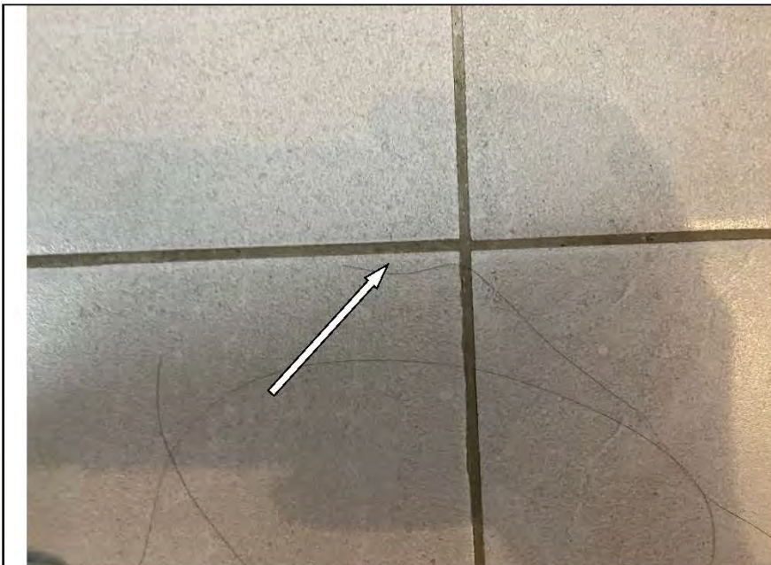
Фото №25. Неровные швы напольной керамической плитки в ванной комнате.
