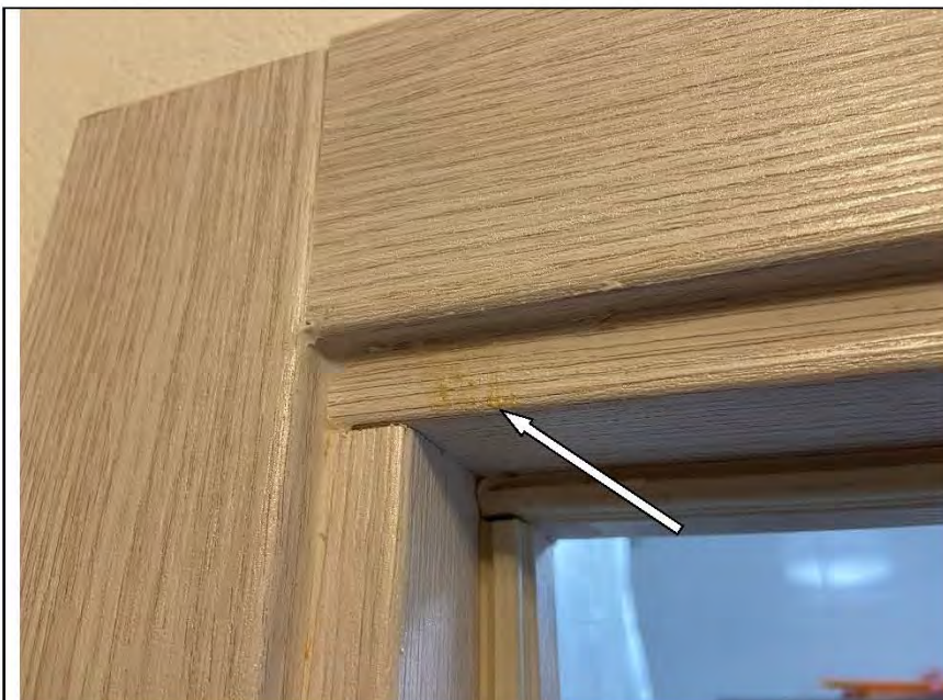
Фото №58. Дефект на коробке деревянного дверного блока в ванной комнате.
