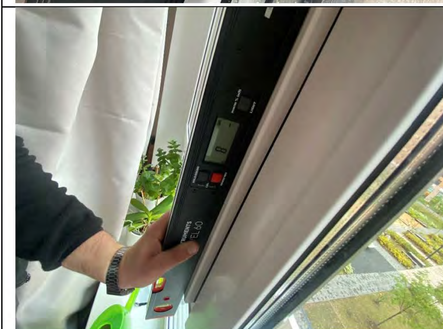
Фото №45. Отклонения от вертикали оконного блока ПВХ в кухне.
