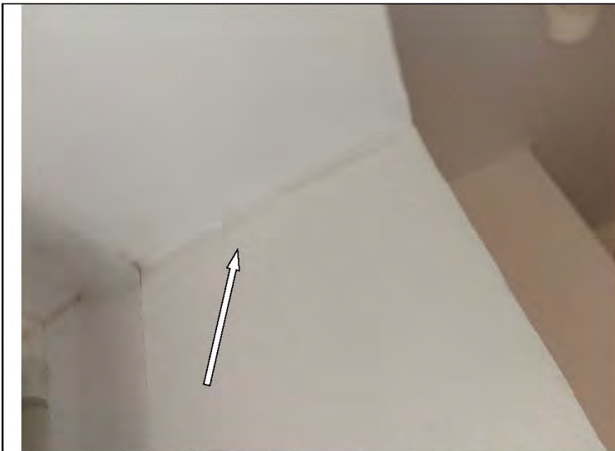
Фото №43. Неровности, выбоины, раковины на окрашенных откосах оконного блока ПВХ в кухне.
