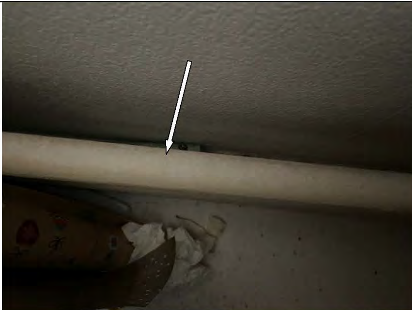
Фото №47. Неровности, подтеки на окрашенных трубах отопления в кухне.
