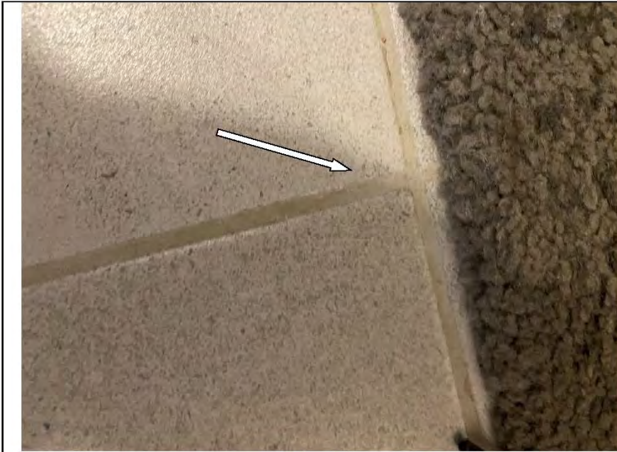
Фото №19. Загрязнения на напольной керамической плитке в коридоре.
