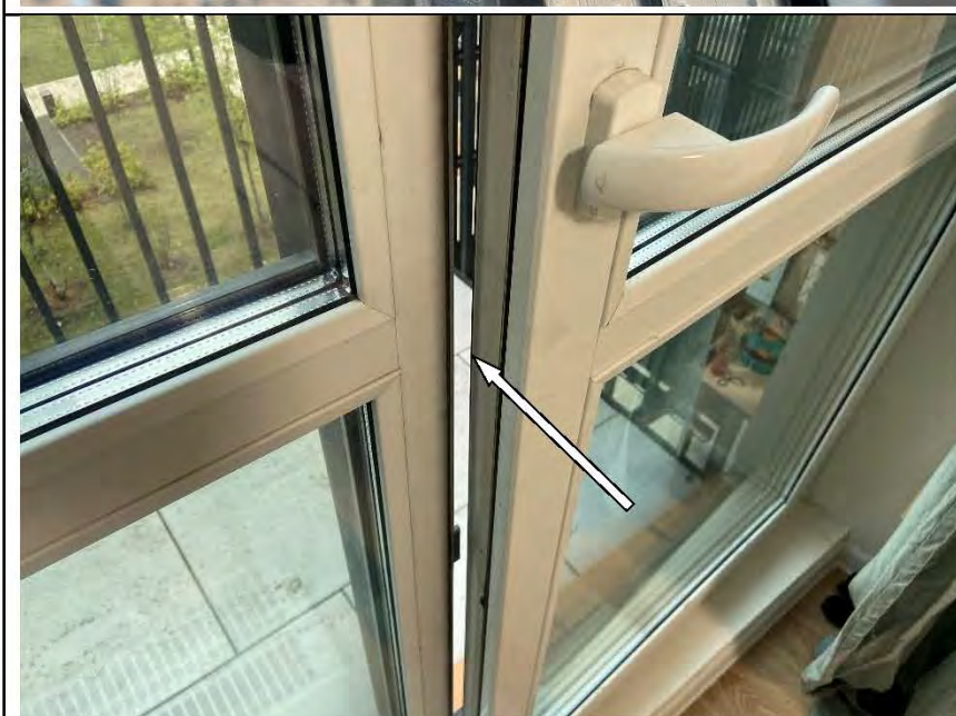
Фото №50. Не отрегулирована створка балконного блока ПВХ в спальне.
