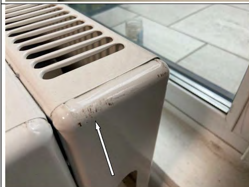
Фото №62. Дефект на поверхности металлического кожуха отопительного прибора в спальне.
