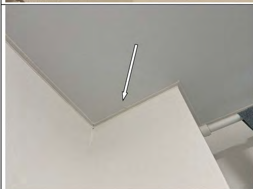
Фото №60. Дефект на поверхности натяжного потолка в спальне.
