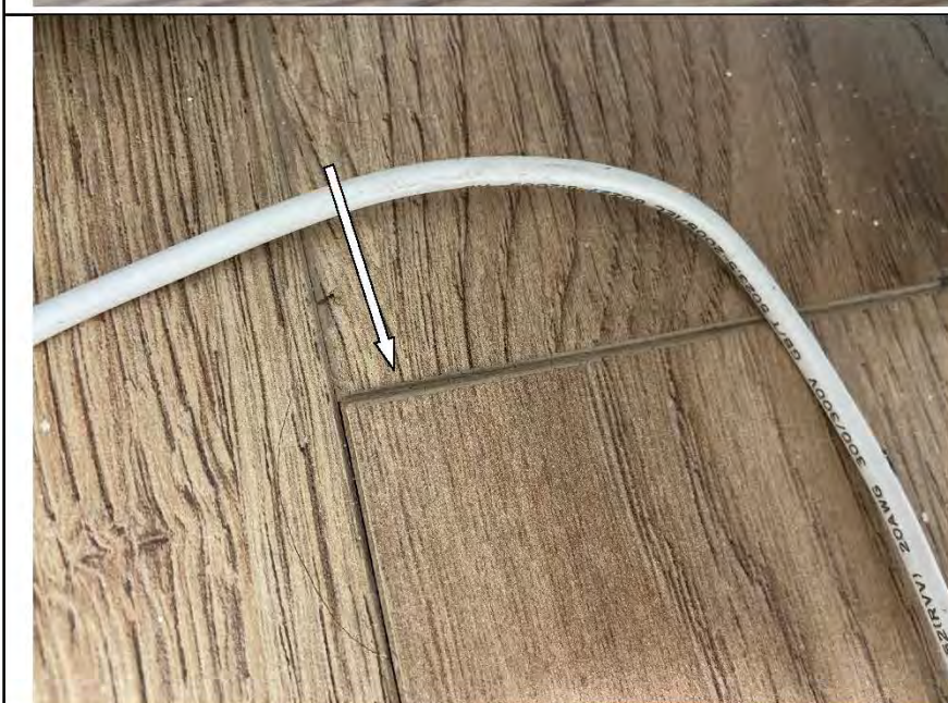
Фото №33. Поднятые кромки досок ламината в спальне.
