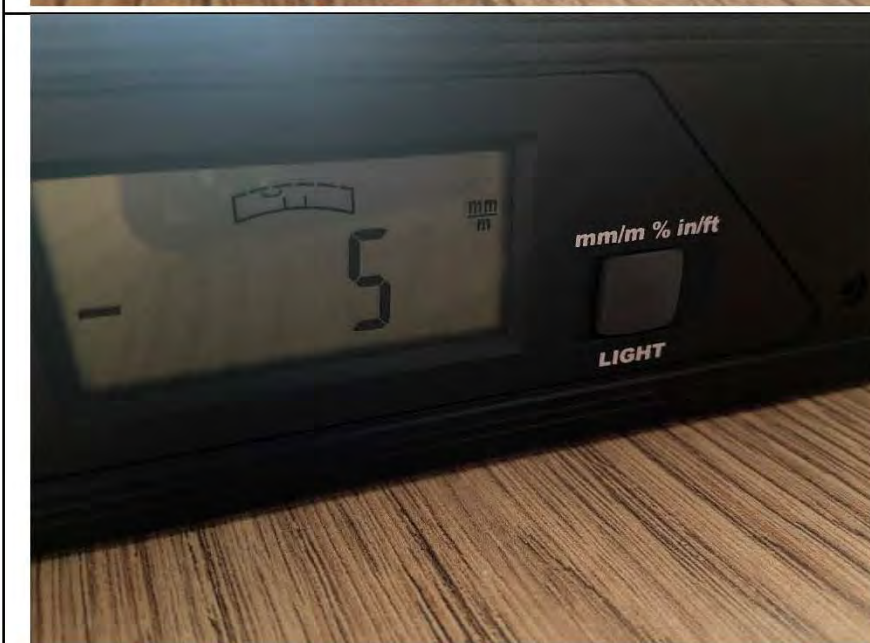
Фото №15. Отклонение поверхности напольного покрытия из ламината в спальне.
