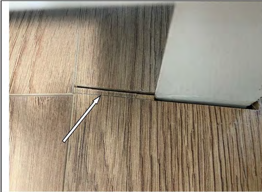
Фото №34. Зазоры между досками ламината в спальне.
