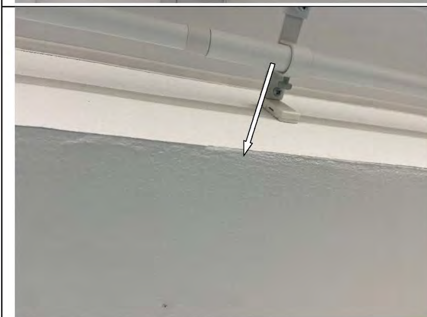
Фото №42. Неровности, выбоины, раковины на окрашенных откосах оконного блока ПВХ в спальне.
