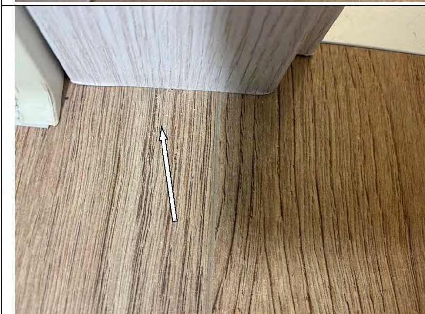
Фото №30. Дефект на напольном покрытии из ламината в спальне.
