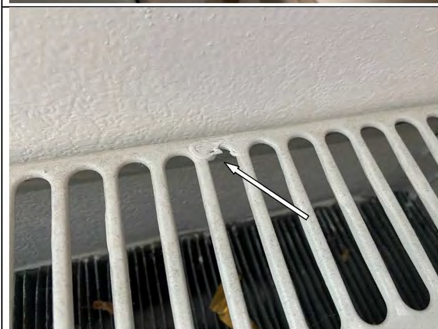
Фото №63. Дефект на поверхности металлического кожуха отопительного прибора в кухне.
