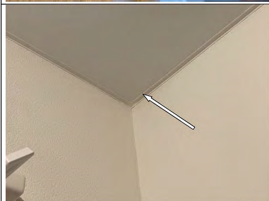
Фото №59. Дефект на поверхности натяжного потолка в коридоре.
