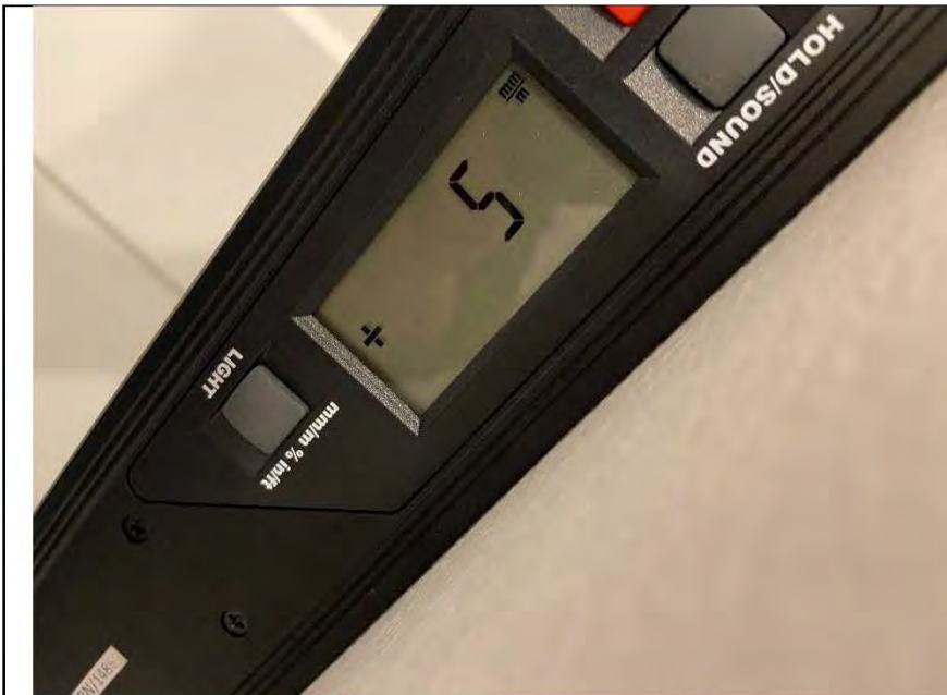
Фото №7. Отклонение поверхности стен от вертикали в коридоре.
