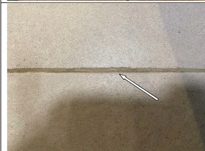
Фото №26. Неровные швы напольной керамической плитки в кухне.
