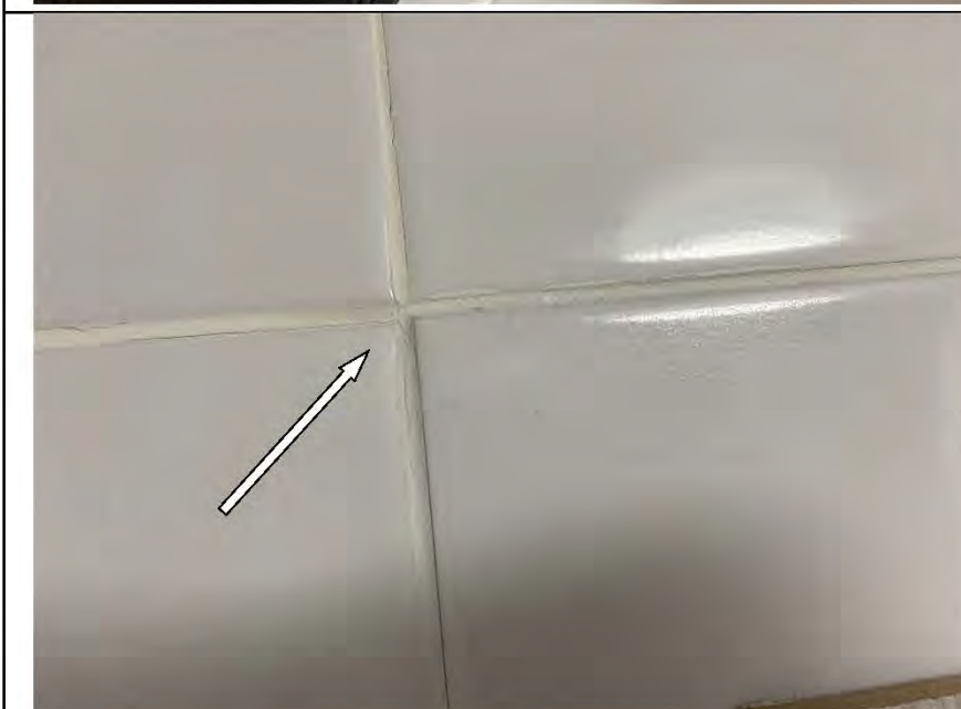
Фото . Загрязнения на настенной керамической плитке в ванной комнате.
