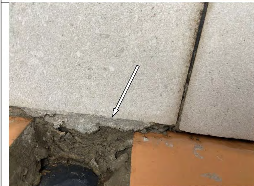
Фото №20. Загрязнения на напольной керамической плитке на балконе.
