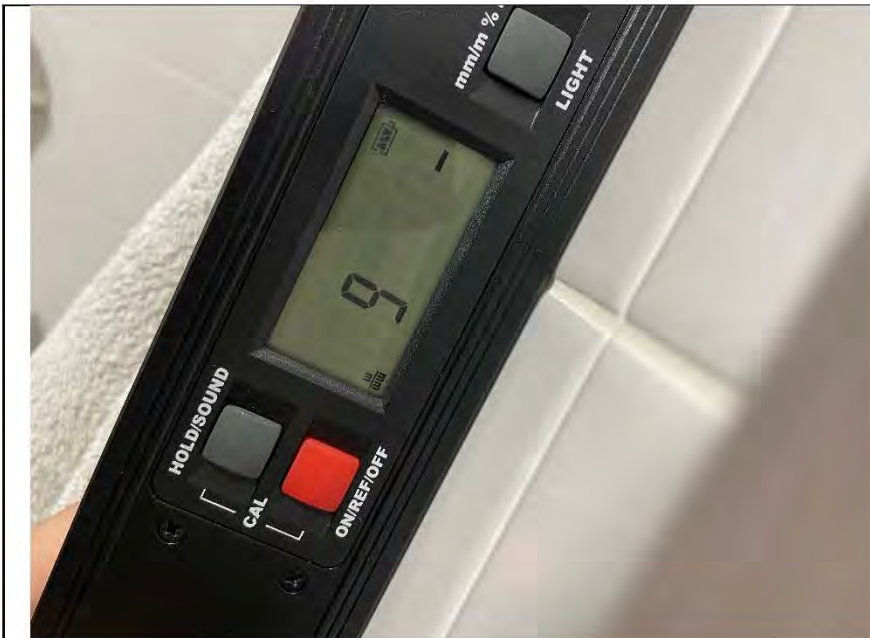
Фото №10. Отклонение поверхности стен от вертикали в ванной комнате.
