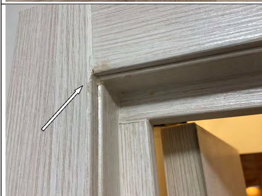
Фото №56. Дефект на наличниках деревянного дверного блока в ванной комнате.
