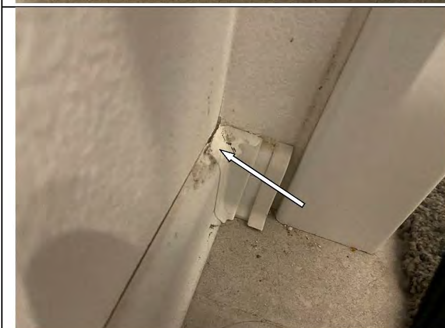
Фото №27. Дефект на напольном плинтусе ПВХ в коридоре.
