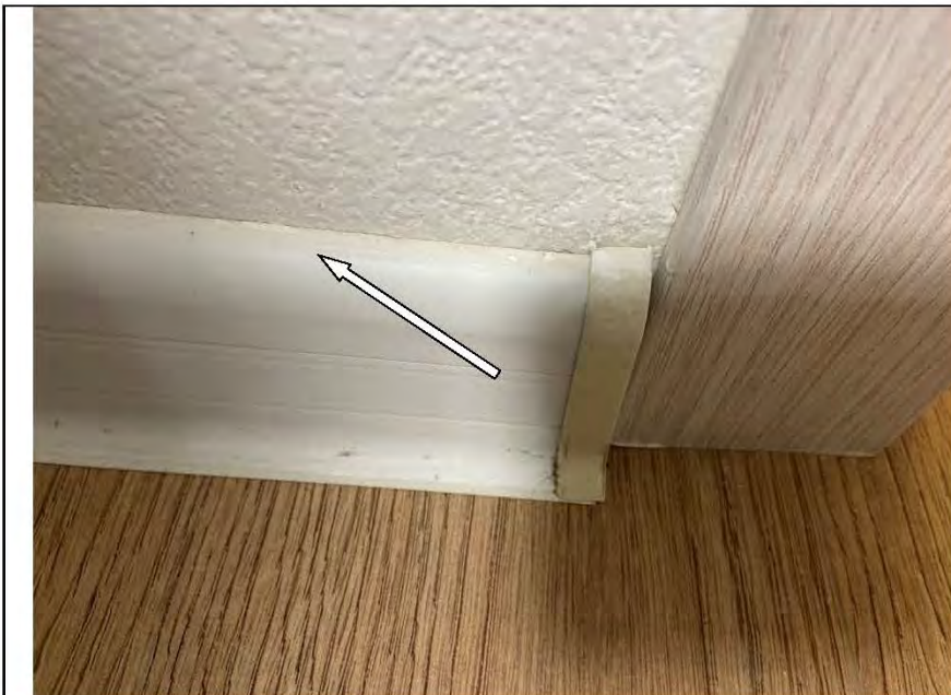
Фото №28. Дефект на напольном плинтусе ПВХ в спальне.
