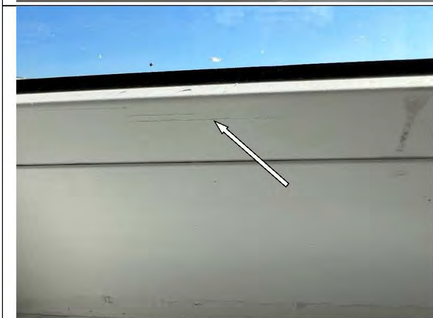
Фото №57. Царапина на профиле ПВХ оконного блока в кухне.
