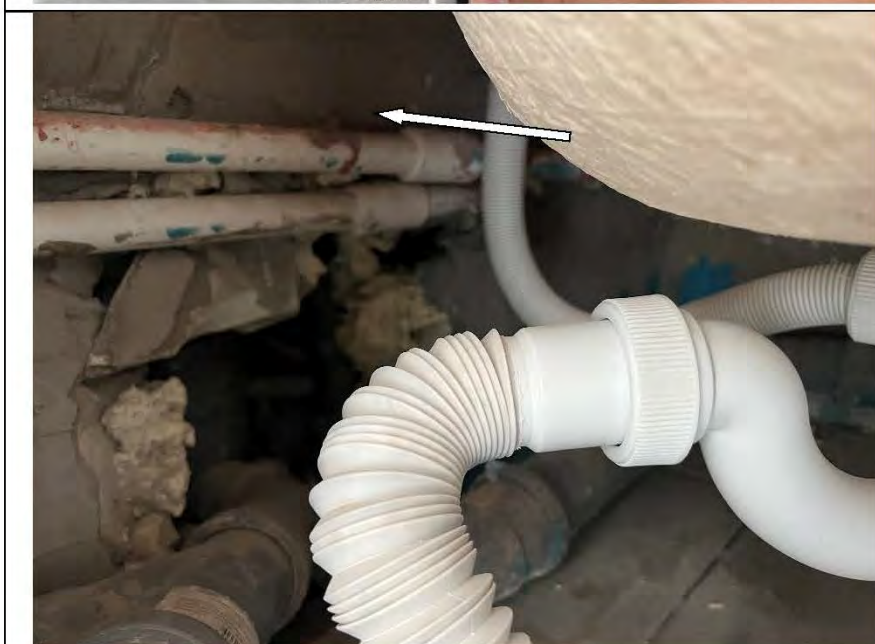
Фото №14. Отсутствует настенная керамическая плитка за ванной.
