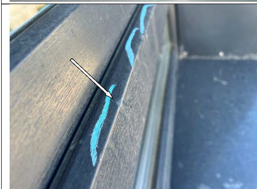
Фото №54. Скол на профиле ПВХ оконного блока в гостиной.
