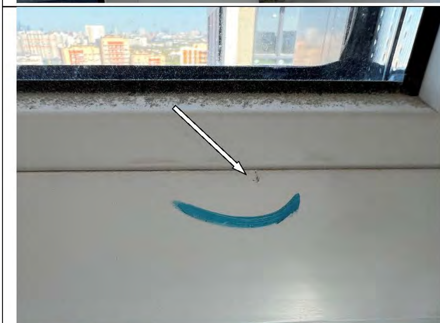
Фото №53. Скол на профиле ПВХ оконного блока в гостиной.
