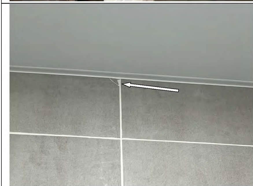
Фото №15. Отбитости настенной керамической плитки в санузле.
