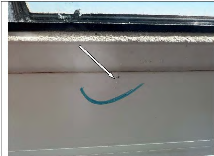
Фото №49. Царапина на профиле ПВХ оконного блока в гостиной.
