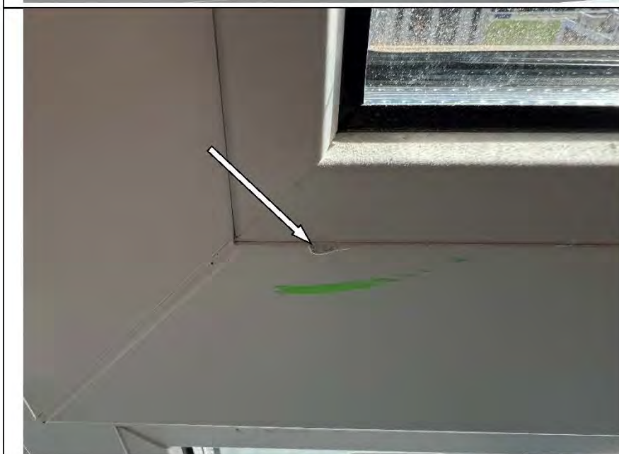
Фото №50. Скол на профиле ПВХ оконного блока в гостиной.
