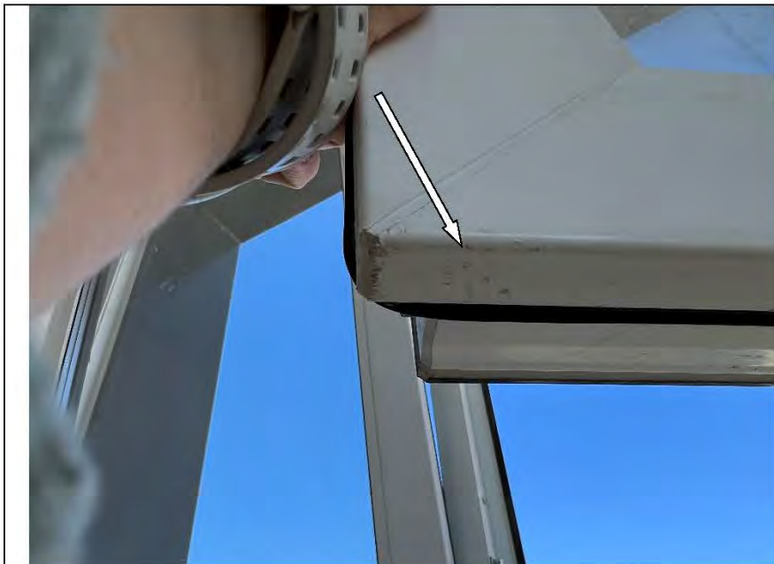
Фото №55. Царапина на профиле ПВХ оконного блока в гостиной.
