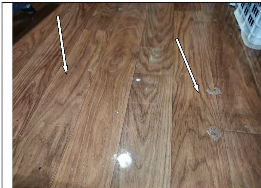
Фото №4. Следы залития на линолеуме (в помещении кладовой уровень воды достигает 2-4 см).
