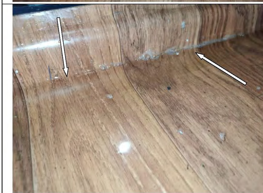
Фото №5. Следы залития на линолеуме (в помещении кладовой уровень воды достигает 2-4 см).
