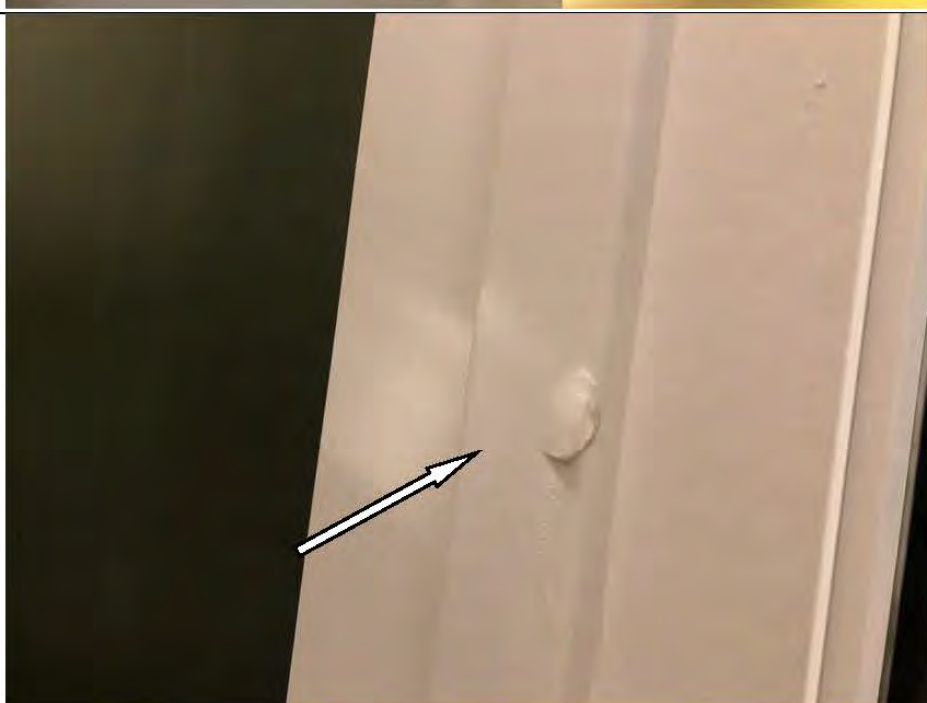
Фото №45. Дефект короба дверного блока санузла в квартире.
