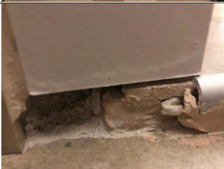
Фото №54. Коротко подрезан наличник дверного блока санузла в квартире.
