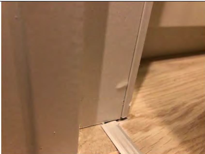
Фото №52. Дефект наличника дверного блока кладовки в квартире.
