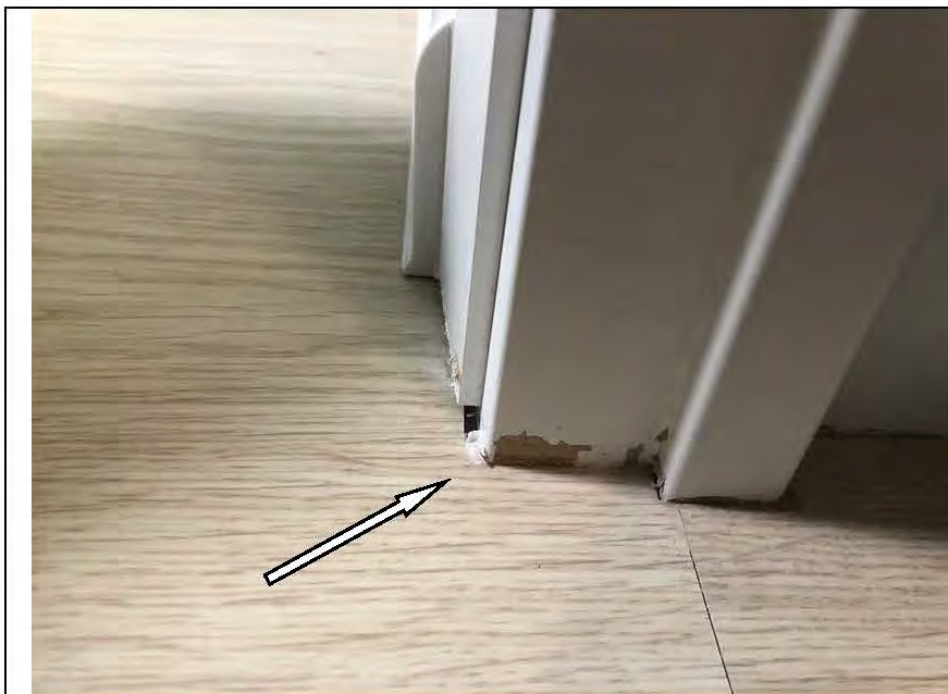
Фото №46. Дефект короба дверного блока гардероба в квартире.
