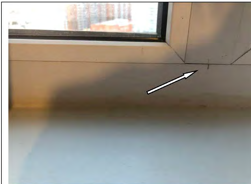
Фото №34. Дефекты профиля ПВХ оконного блока в спальне квартиры.
