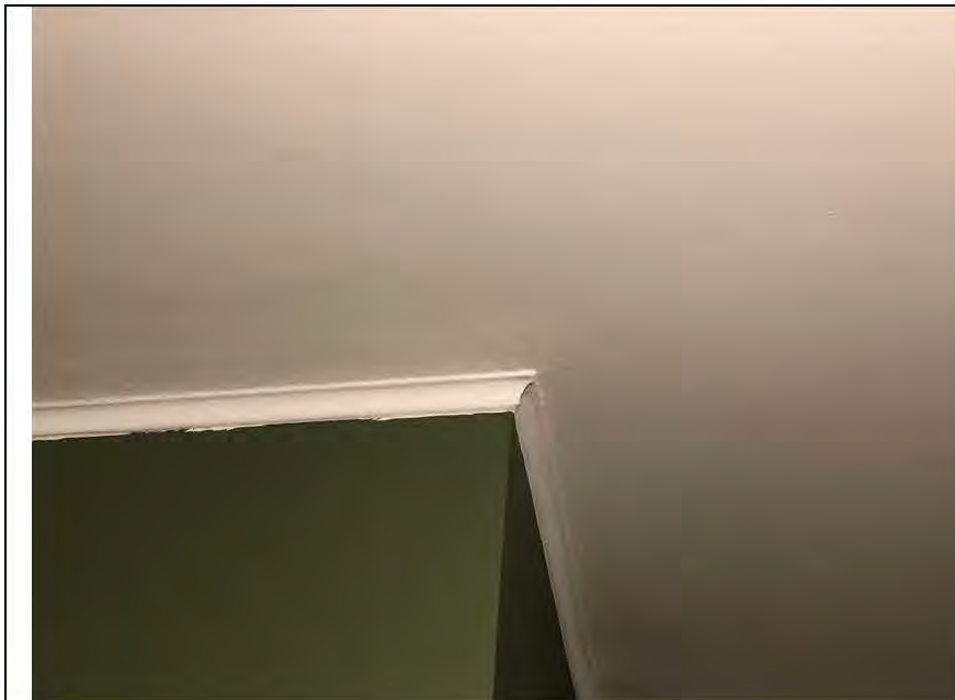
Фото №61. Дефекты окрашенного потолка кладовки в квартире.
