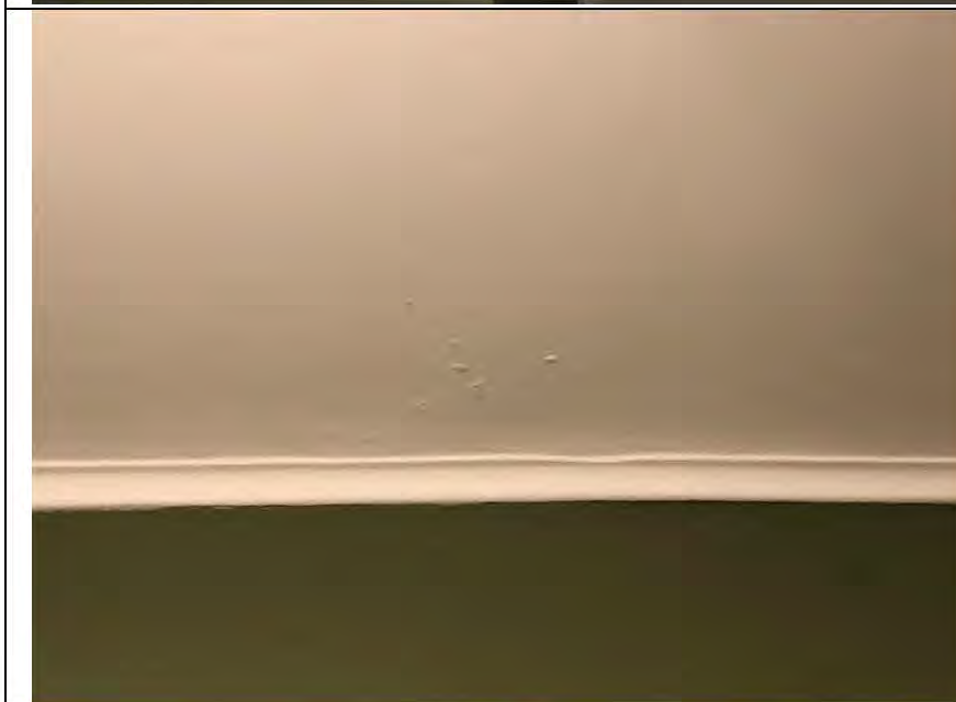
Фото №62. Дефекты окрашенного потолка коридора в квартире.
