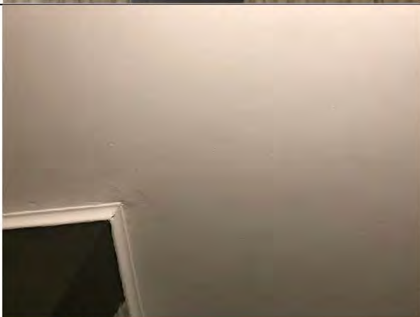
Фото №56. Дефекты окрашенного потолка санузла в квартире.
