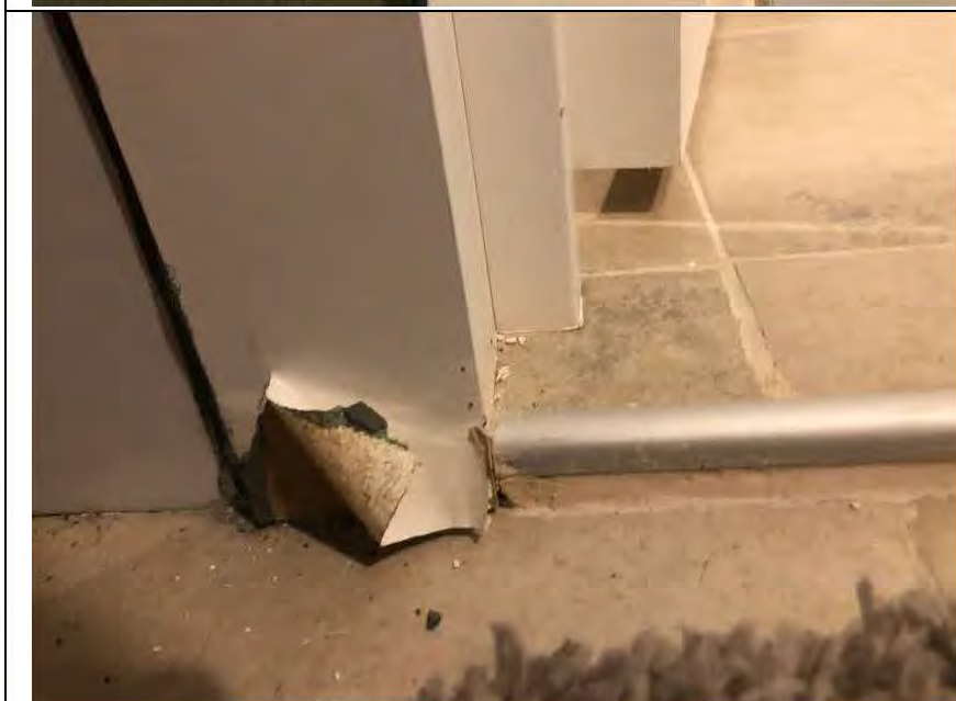
Фото №50. Дефект наличника дверного блока ванной комнаты в квартире.
