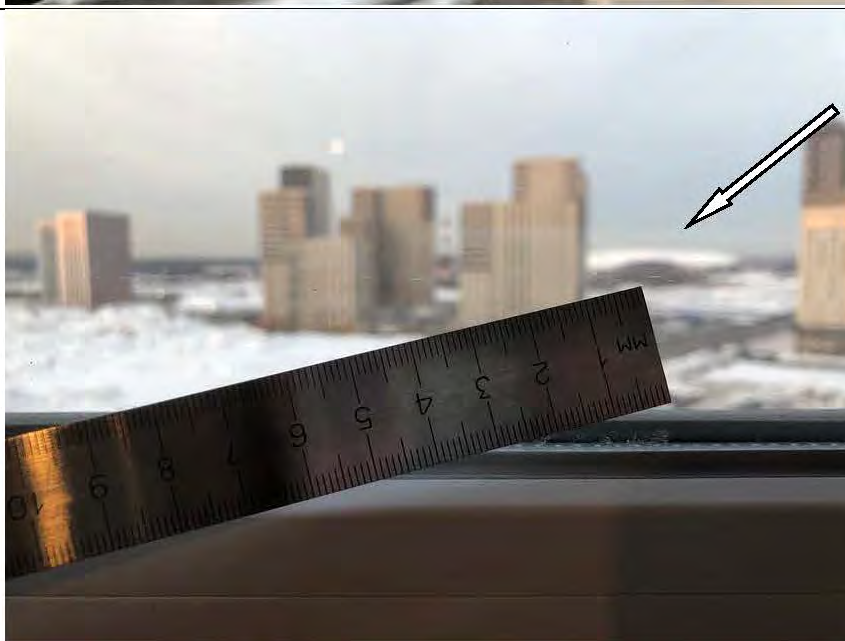
Фото №24. Царапины на стеклопакете оконного блока кухни в квартире.
