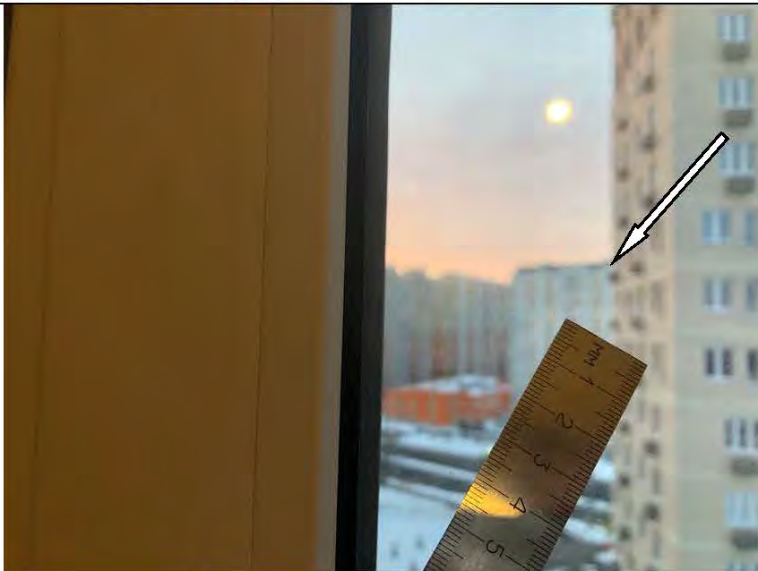
Фото №26. Царапины на стеклопакете оконного блока спальни в квартире.
