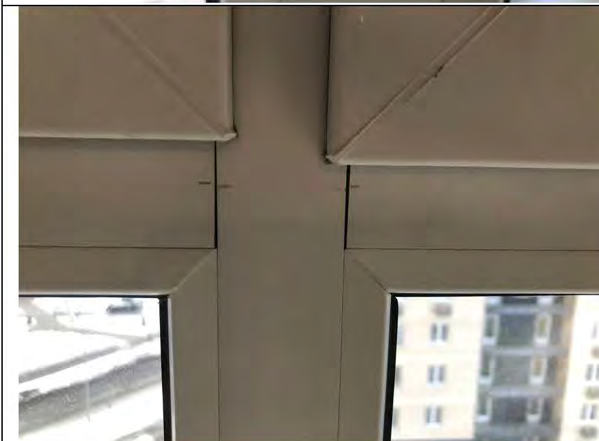
Фото №29. Дефекты профиля ПВХ и щели в оконном блоке на кухне квартиры.
