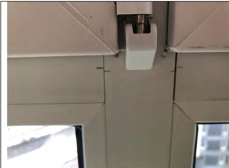
Фото №28. Дефекты профиля ПВХ и щели в оконном блоке на кухне квартиры.
