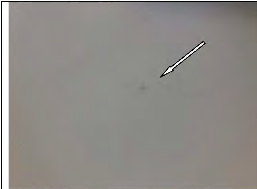
Фото №40. Дефект (вмятина) на лицевой поверхности подоконной доски в детской квартиры
