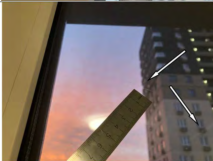
Фото №27. Царапины на стеклопакете оконного блока детской в квартире.
