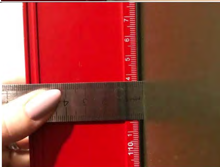
Фото №15. Отклонение окрашенной стены санузла в квартире.
