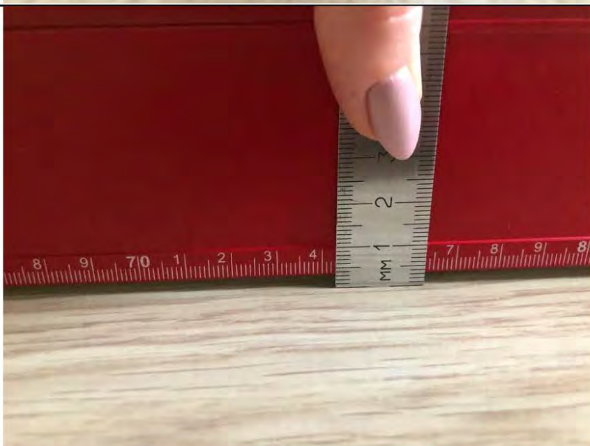
Фото №11. Измерение уровня ламината пола кухни в квартире.
