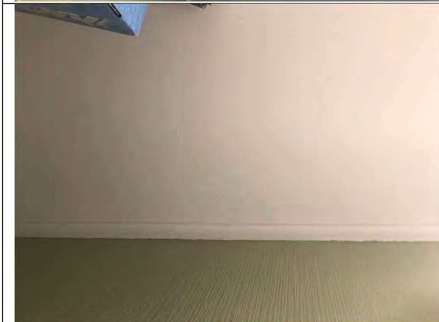
Фото №60. Дефекты окрашенного потолка гардероба в квартире.
