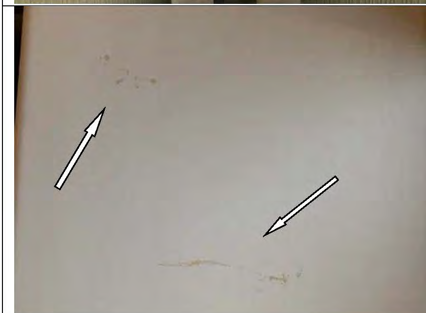
Фото №39. Дефекты на лицевой поверхности подоконной доски на кухне квартиры.
