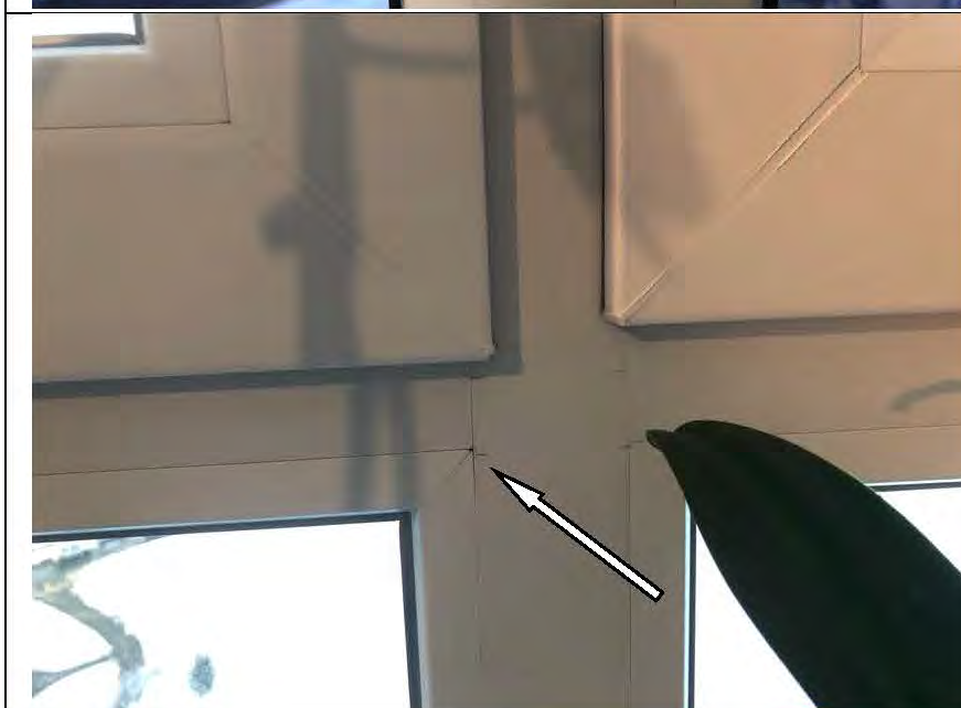
Фото №33. Дефекты профиля ПВХ оконного блока на кухне квартиры.
