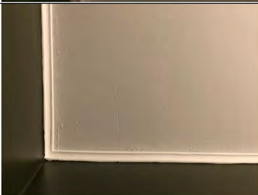
Фото №57. Дефекты окрашенного потолка ванной комнаты в квартире.
