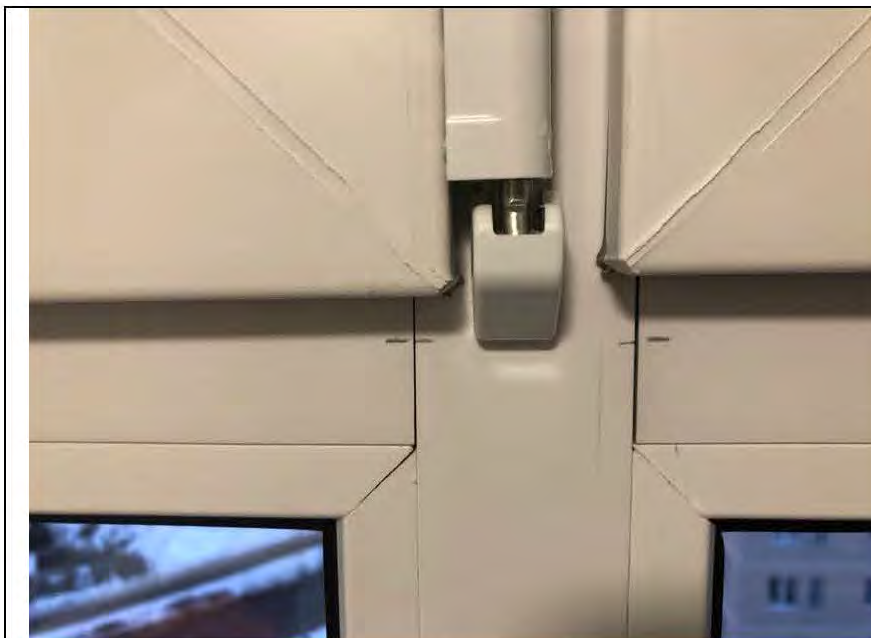
Фото №31. Дефекты профиля ПВХ и щели в оконном блоке в детской квартиры.
