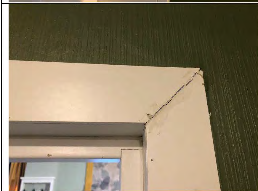
Фото №48. Дефект наличника дверного блока кухни в квартире.
