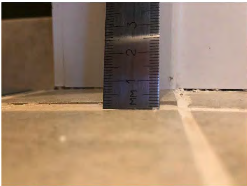
Фото №43. Уступ керамической плитки санузла в квартире.
