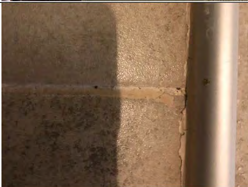
Фото №66. Неровный шов напольной плитки санузла в квартире.
