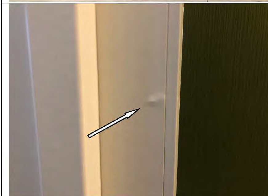
Фото №47. Дефект наличника дверного блока кухни в квартире.
