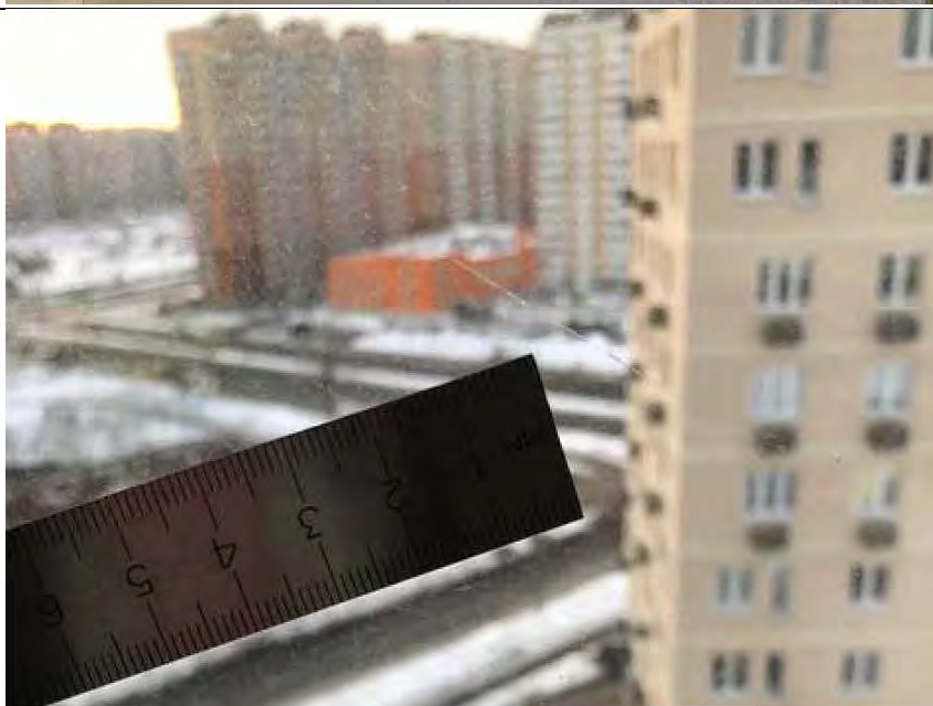
Фото №23. Царапины на стеклопакете оконного блока кухни в квартире.
