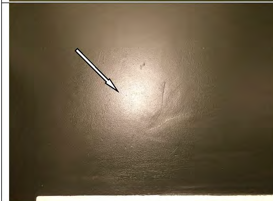
Фото №63. Дефекты окрашенной стены санузла в квартире.
