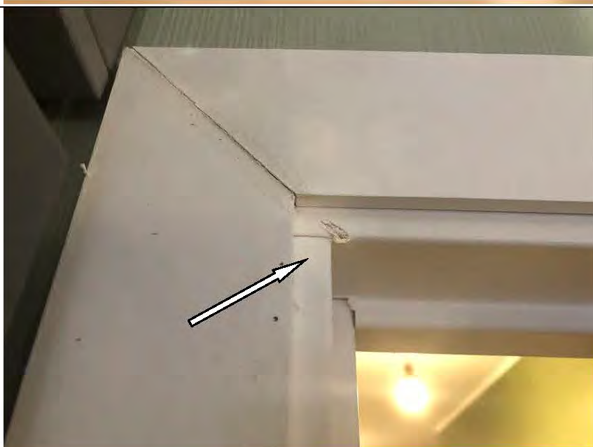
Фото №44. Дефекты короба дверного блока кухни в квартире.
