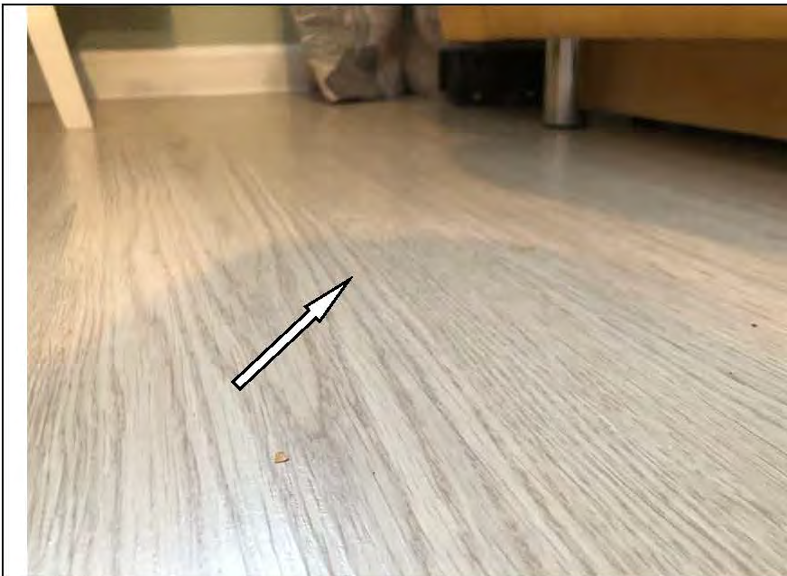
Фото №16. Поднятие кромки ламината кухни в квартире.
