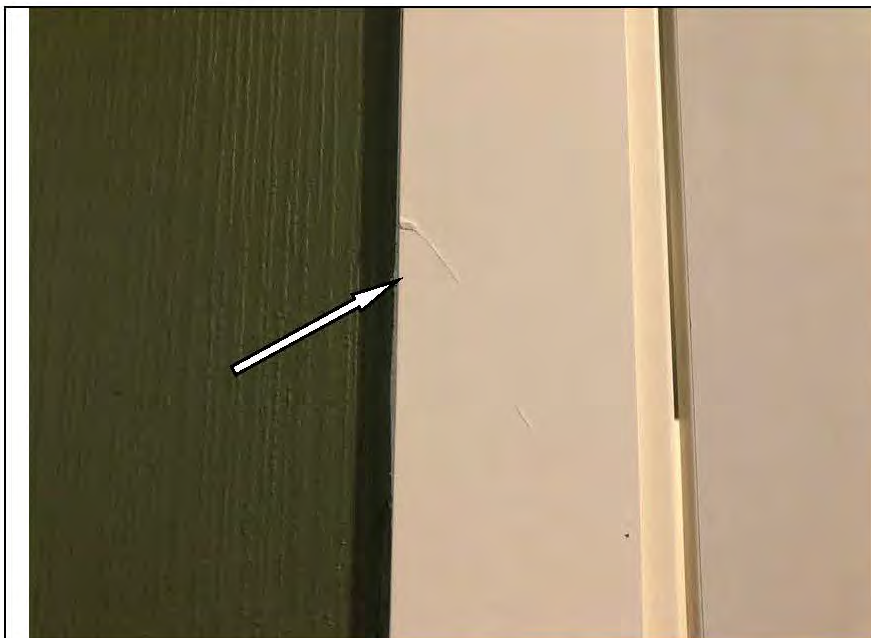
Фото №49. Дефект наличника дверного блока санузла в квартире.
