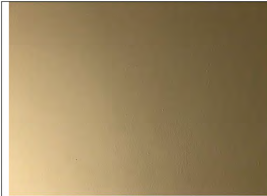
Фото №58. Дефекты окрашенного потолка спальни в квартире.
