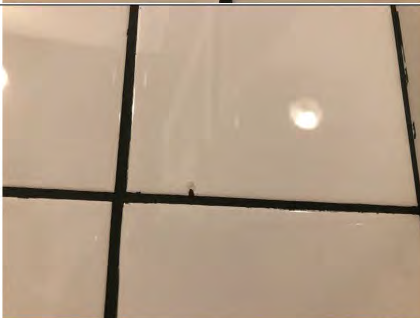
Фото №68. Скол настенной плитки ванной комнаты в квартире.
