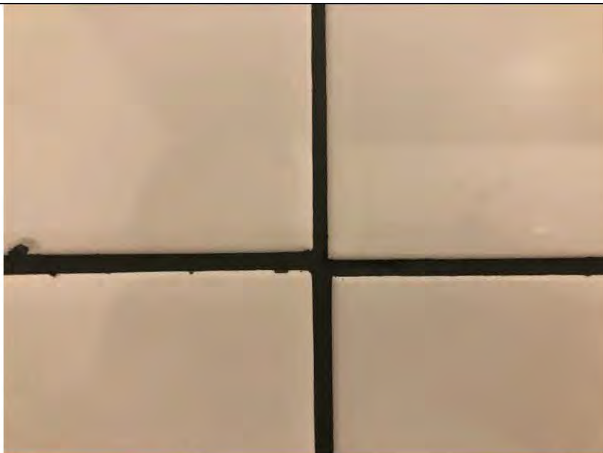
Фото №67. Непараллельный шов настенной плитки ванной комнаты в квартире.
