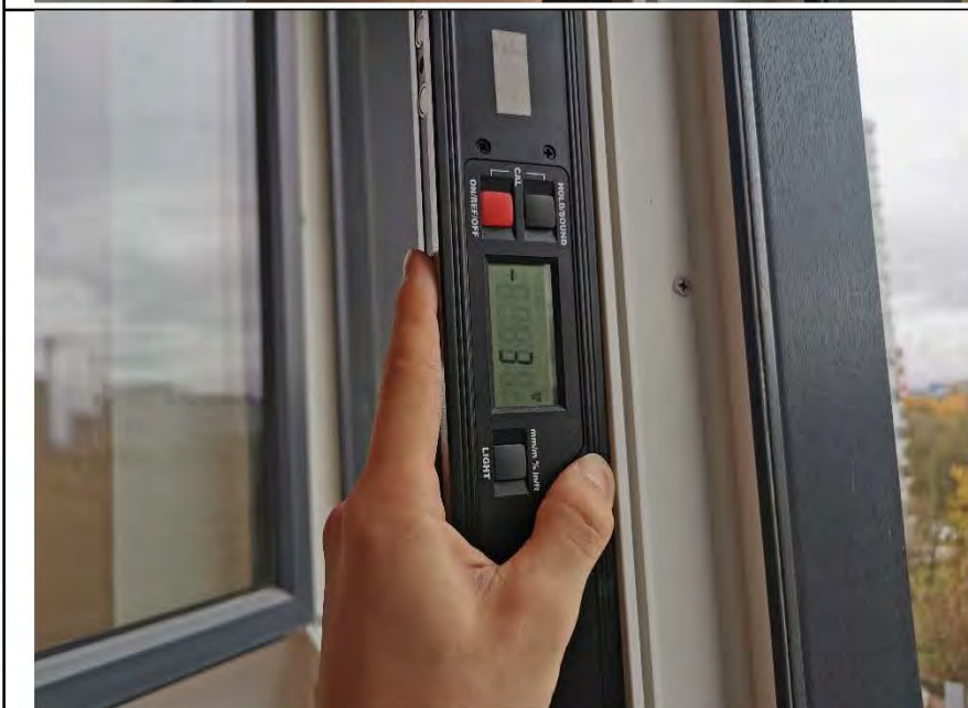
Фото №50. Отклонение ПВХ оконного блока по уровню вертикальности в кухне.
