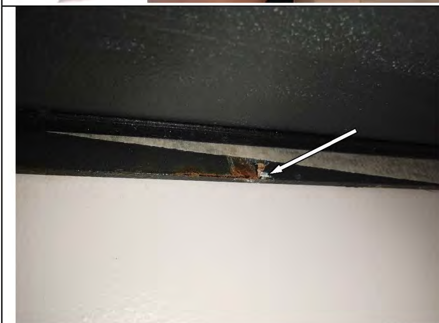
Фото №72. Коррозия на полотне входного дверного блока.
