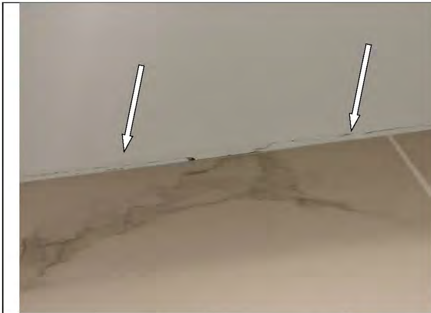
Фото №34. Трещины на отштукатуренном потолке в ванной комнате.
