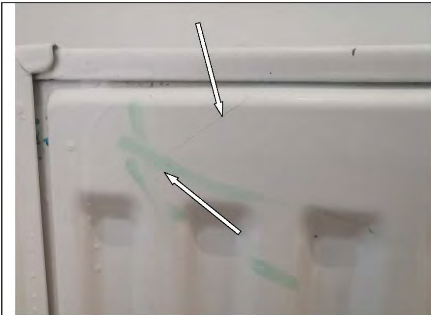
Фото №76. Царапины на радиаторе в кухне.
