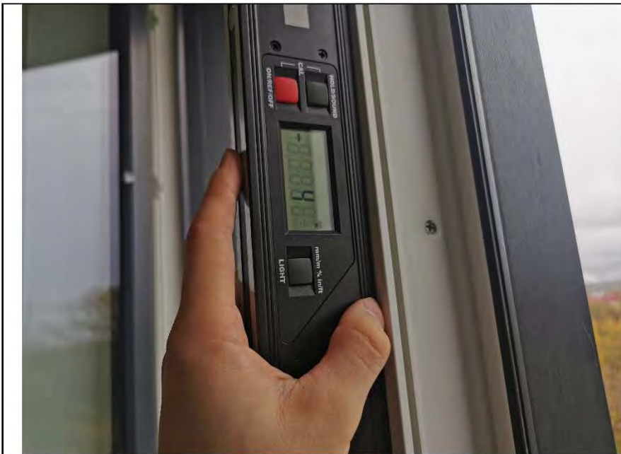
Фото №49. Отклонение ПВХ оконного блока по уровню вертикальности в спальне.
