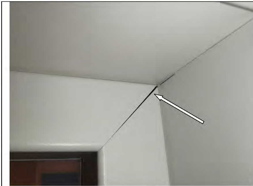
Фото №64. Элементы дверного блока (короба) соединены не надежно в ванной комнате.
