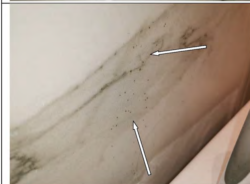
Фото №20. Окалины на настенной керамической плитке в ванной комнате.
