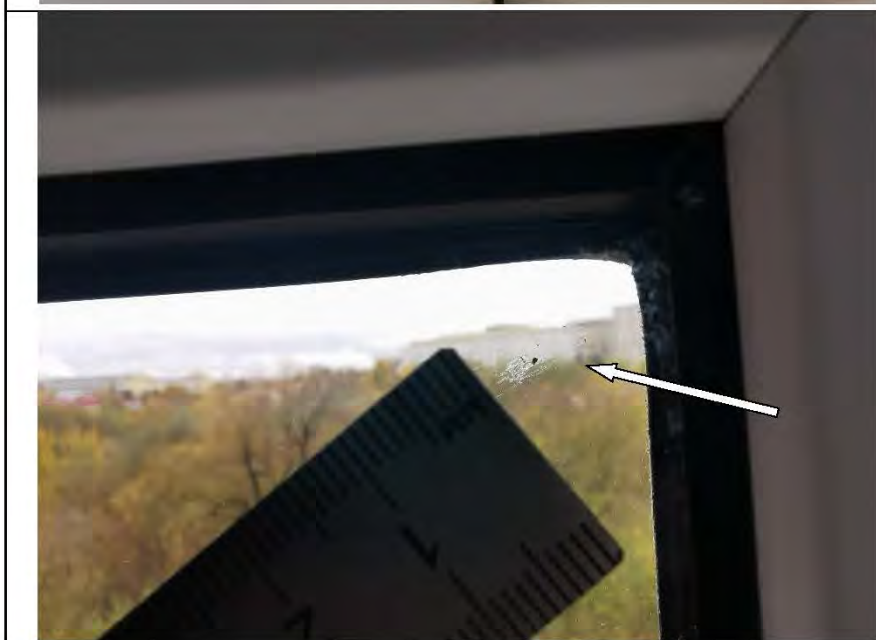
Фото №42. Окалины на стеклопакете оконного блока ПВХ в спальне.
