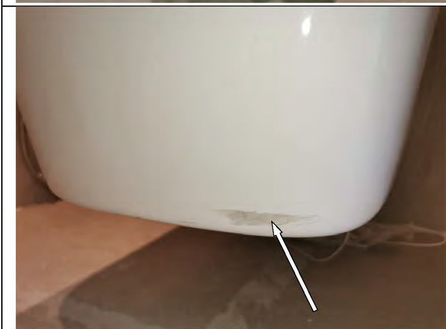
Фото №78. Загрязнение на унитазе в санузле.
