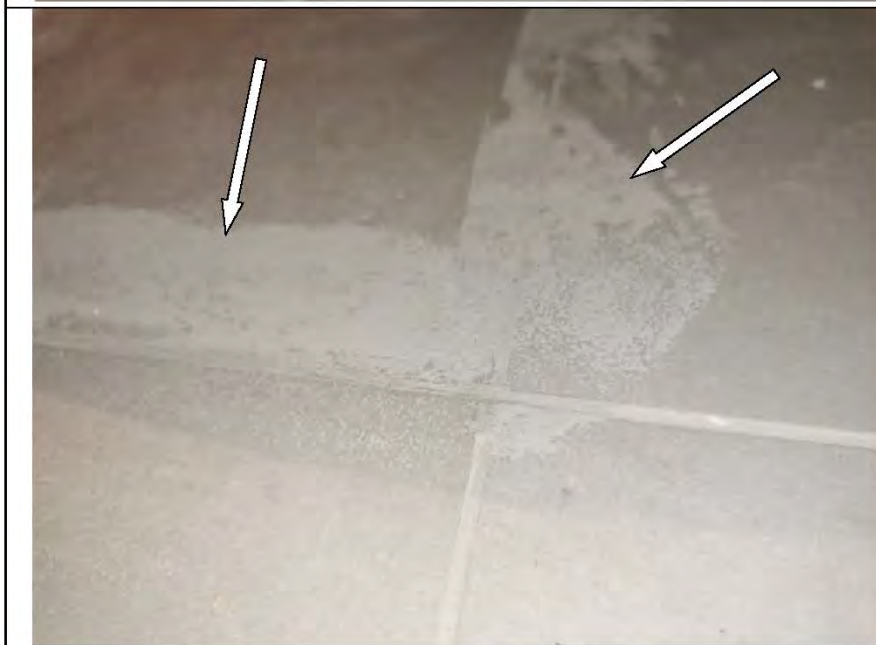
Фото №32. Загрязнение напольной керамической плитки в санузле.
