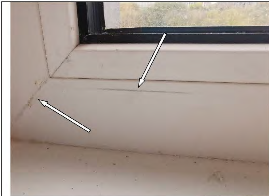
Фото №40. Потертости и загрязнения на профиле ПВХ оконного блока в кухне.
