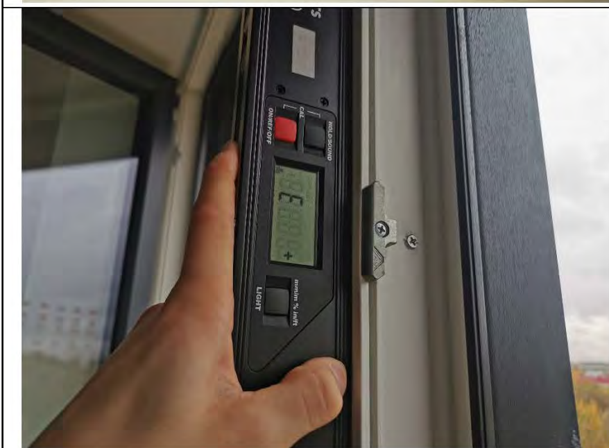
Фото №48. Отклонение ПВХ оконного блока по уровню вертикальности в детской.
