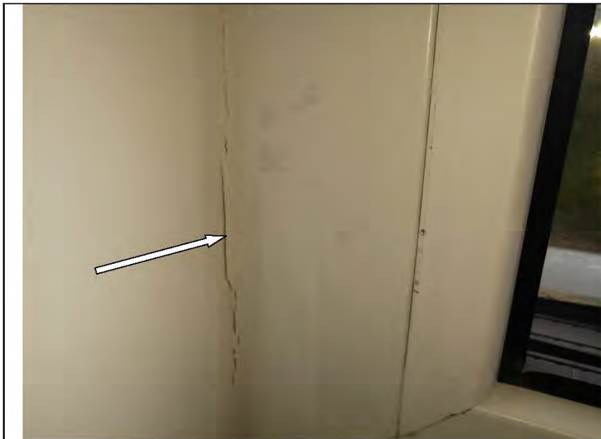
Фото №55. Трещины на окрашенных откосах оконного блока ПВХ в детской.
