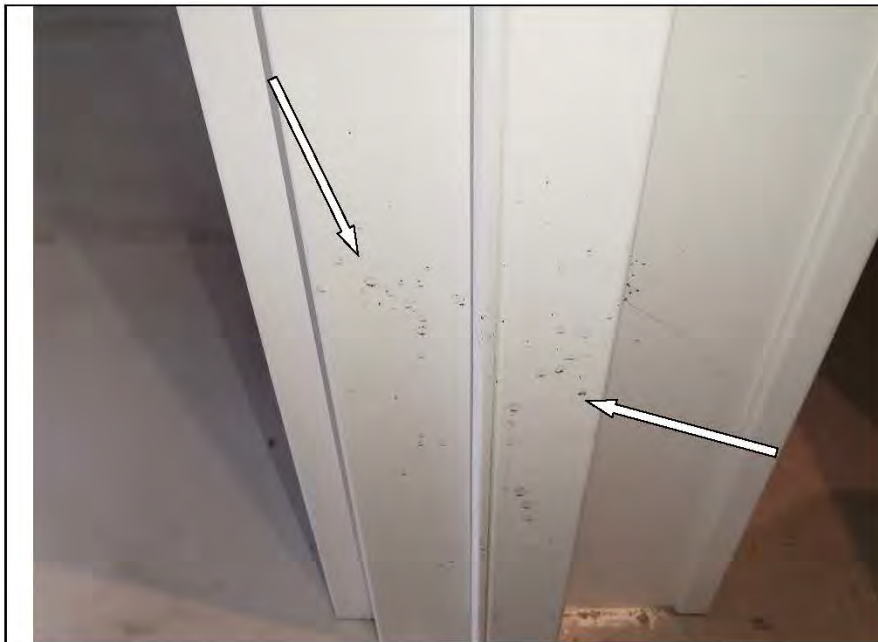
Фото №61. Загрязнение короба деревянного дверного блока в санузле.
