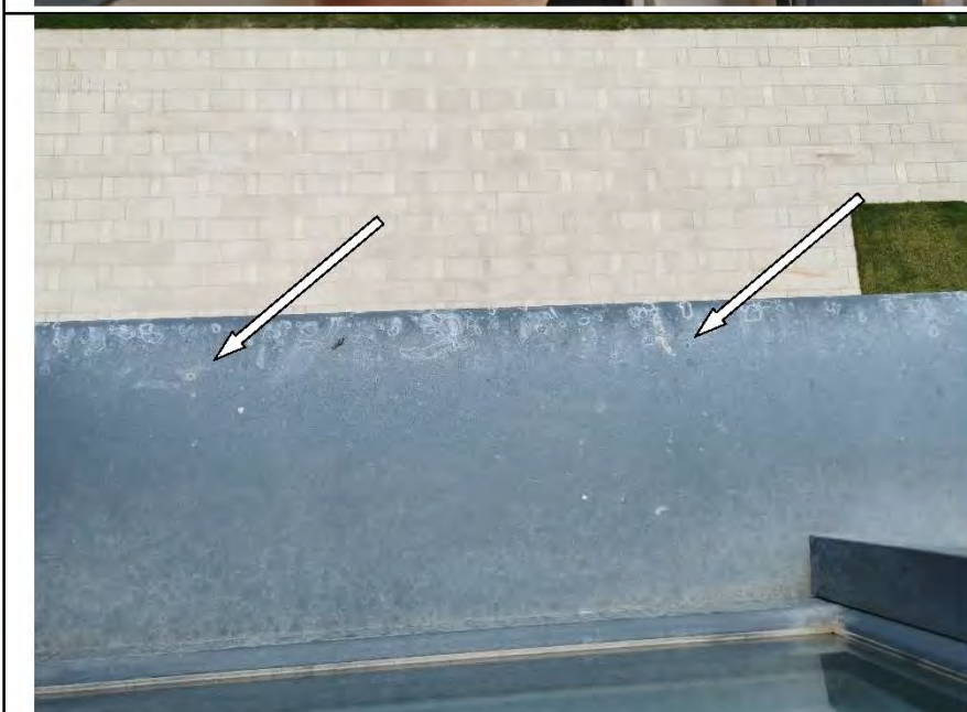
Фото №51. Загрязнения на металлическом отливе оконного блока в детской.
