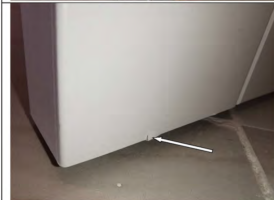
Фото №62. Повреждение ламинации полотна деревянного дверного блока в кухне.
