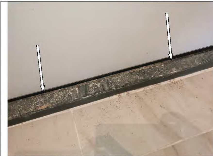
Фото №73. Загрязнения и потертости на коробе входного дверного блока.
