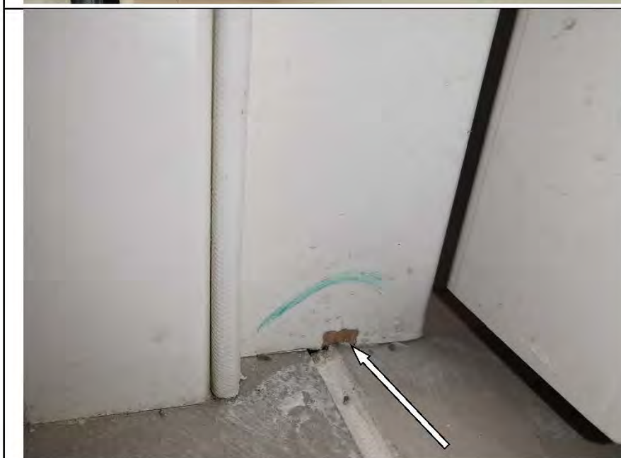
Фото №57. Повреждение ламинации короба деревянного дверного блока в ванной комнате.
