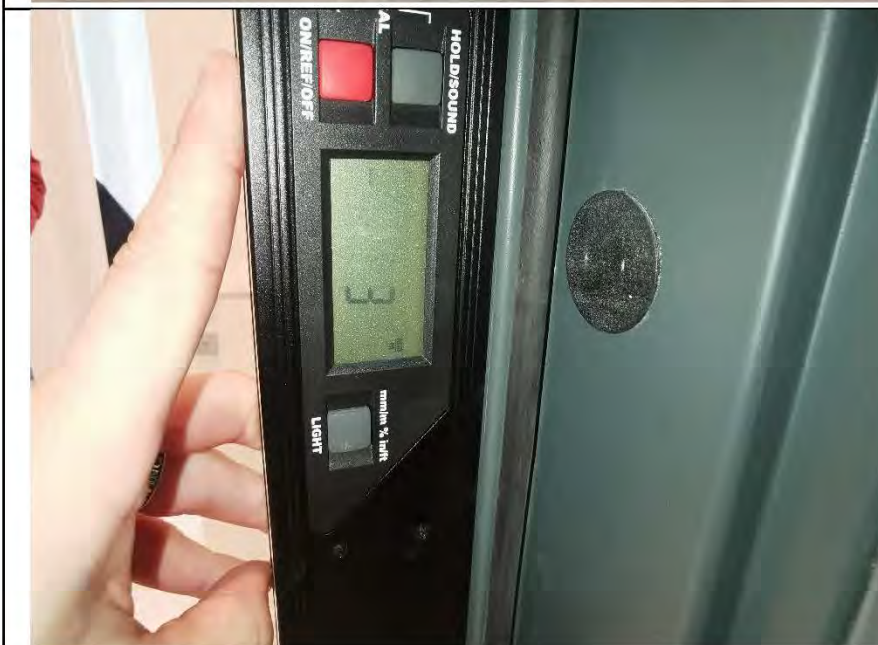
Фото №74. Отклонение коробки входного дверного блока.
