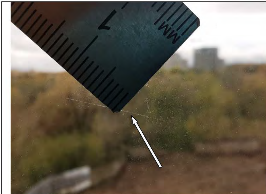
Фото №43. Царапины на стеклопакете оконного блока ПВХ в кухне.
