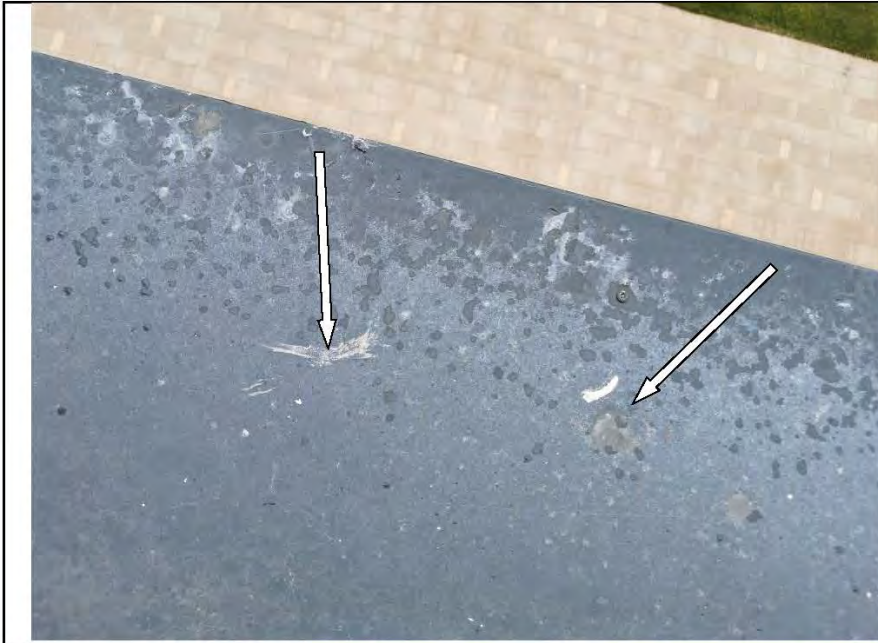
Фото №52. Загрязнения и царапины на металлическом отливе оконного блока в спальне.
