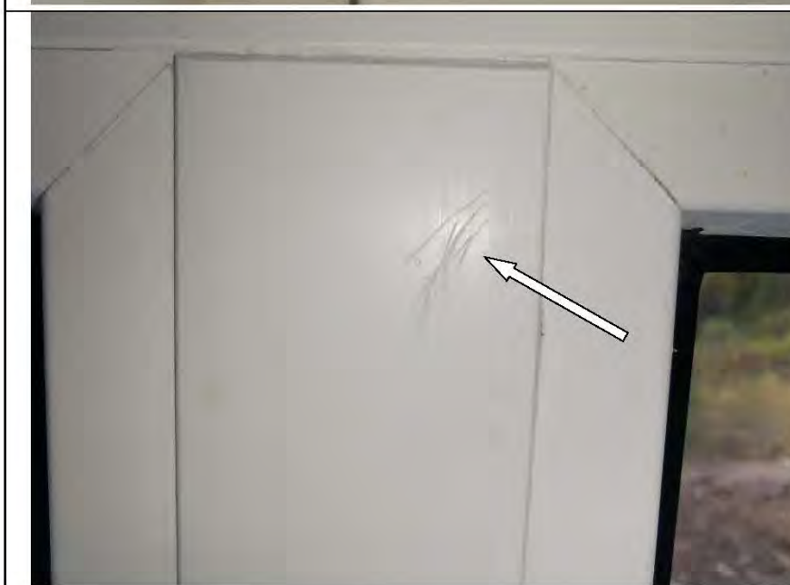
Фото №36. Царапины на профиле ПВХ оконного блока в детской.
