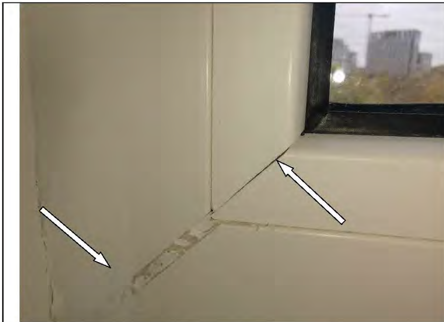
Фото №37. Загрязнения на профиле, зазор в месте стыка профилей ПВХ оконного блока в детской.
