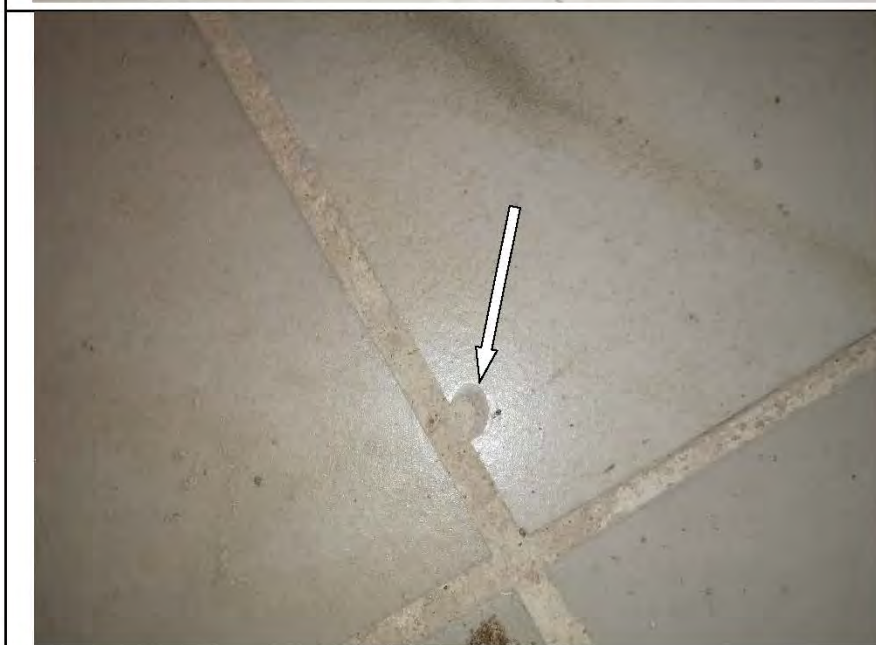
Фото №33. Напольная керамическая плитка в коридоре имеет отбитости.
