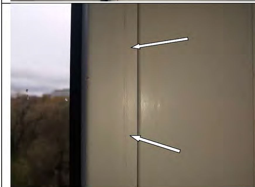
Фото №39. Царапины на профиле ПВХ оконного блока в спальне.
