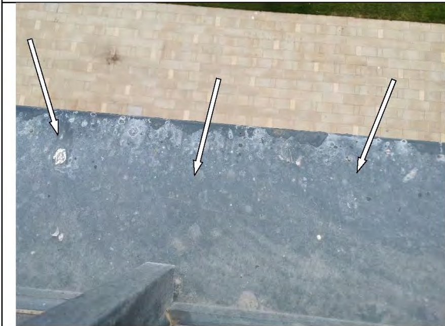
Фото №53. Загрязнения и царапины на металлическом отливе оконного блока в кухне.
