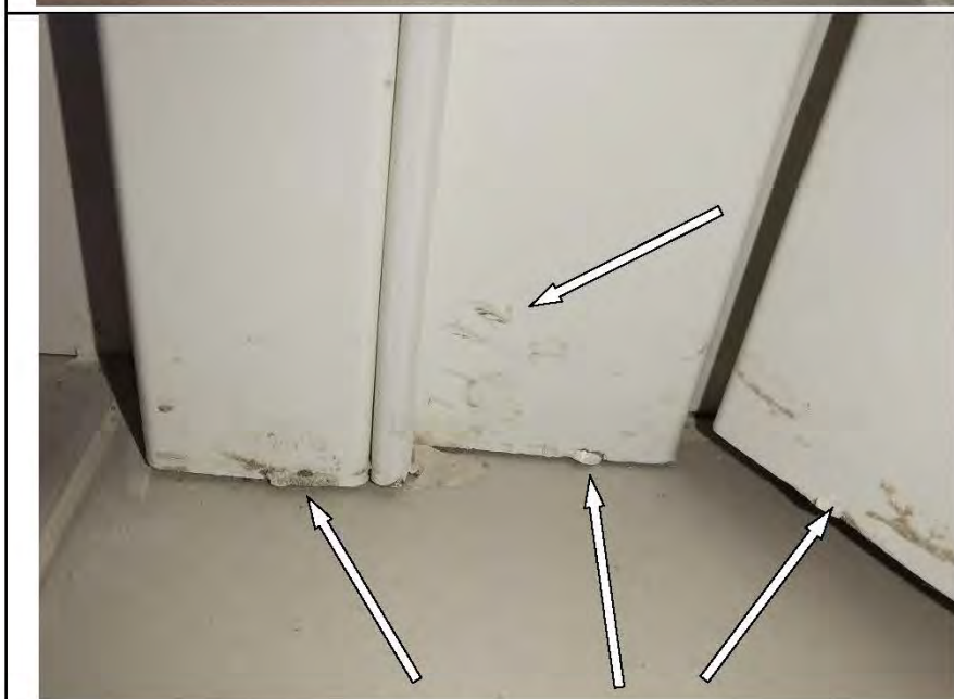
Фото №63. Повреждение ламинации, загрязнение короба и полотна деревянного дверного блока в кухне.
