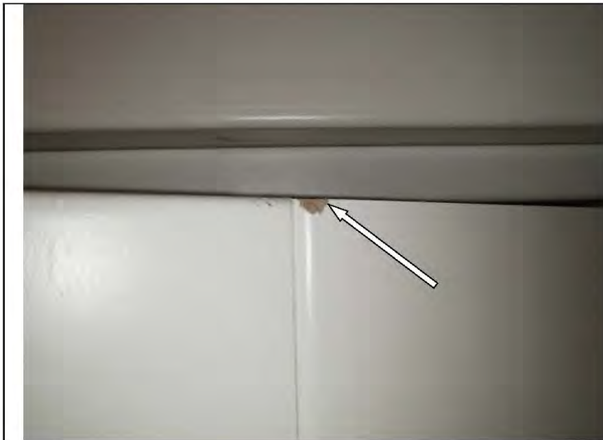
Фото №58. Повреждение ламинации полотна деревянного дверного блока в ванной комнате.
