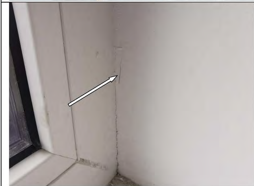
Фото №54. Трещины на окрашенных откосах оконного блока ПВХ в спальне.
