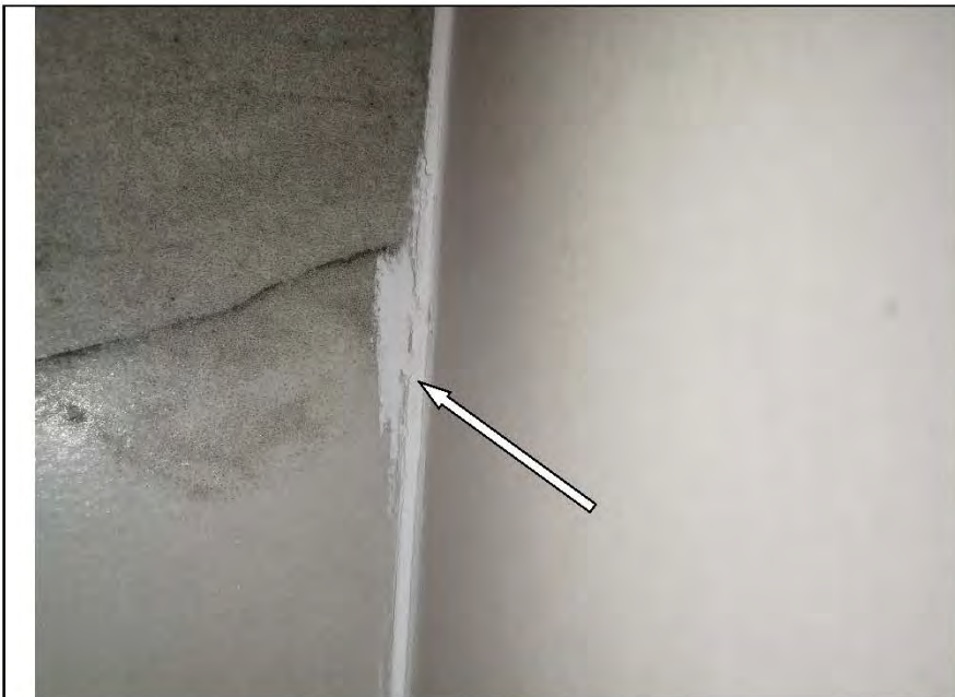
Фото №22. Загрязнение настенной керамической плитки затирочным составом в санузле.
