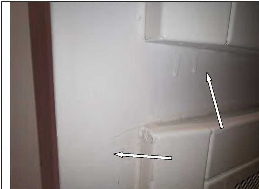
Фото №13. Некачественно выполнено окрашивание стен в коридоре.
