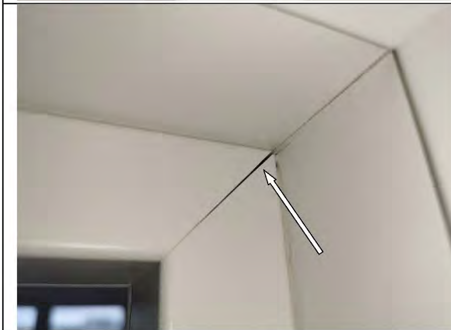
Фото №65. Элементы дверного блока (короба) соединены не надежно в спальне.
