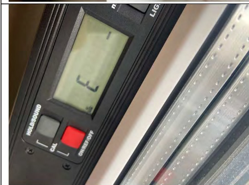
Фото №39. Отклонение от вертикали оконного блока ПВХ в спальне.
