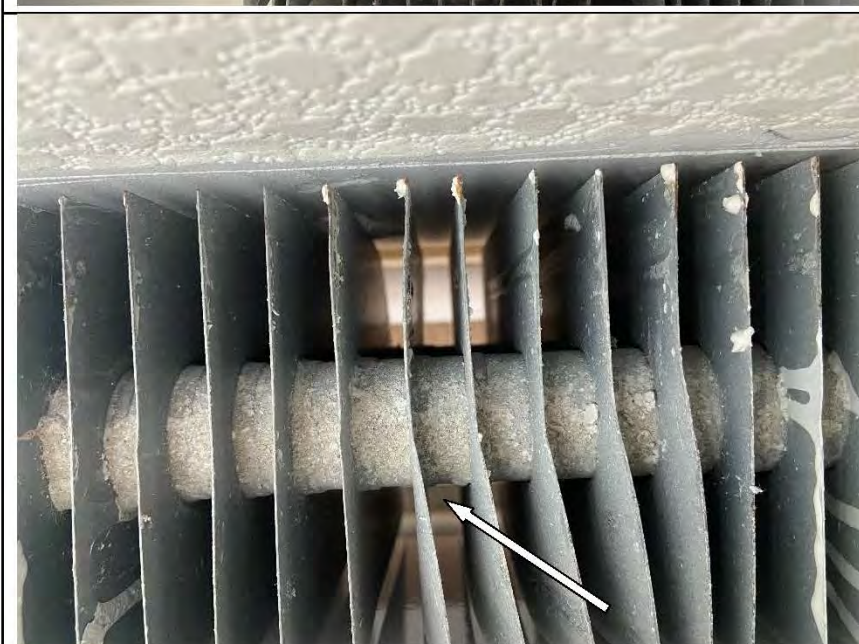
Фото №65. Загиб радиатора в спальне.
