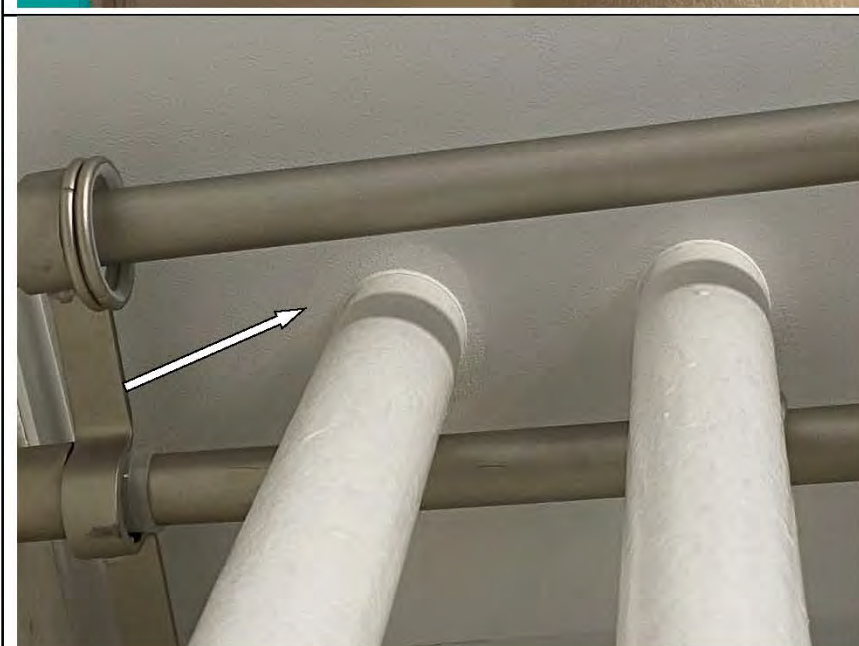
Фото №59. Дефект на поверхности натяжного потолка в кухне.
