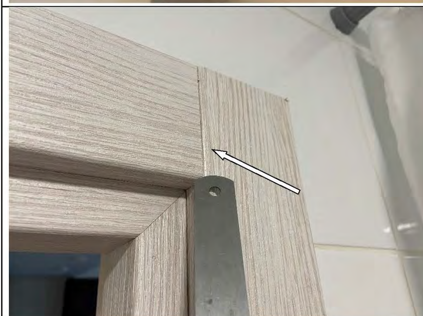
Фото №51. Дефект на наличниках деревянного дверного блока в ванной комнате.
