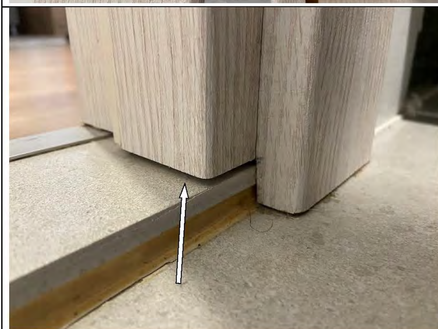
Фото №54. Дефект на коробке деревянного дверного блока в ванной комнате.
