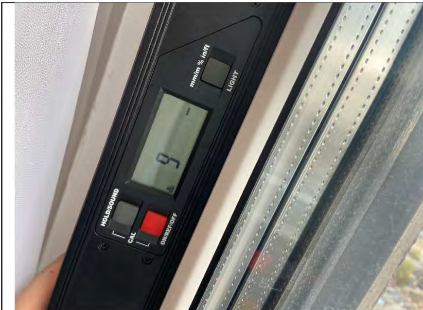
Фото №40. Отклонение от вертикали оконного блока ПВХ в кухне.
