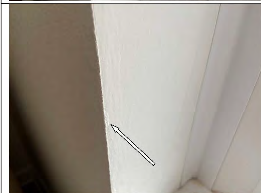
Фото №38. Неровности, выбоины, раковины на окрашенных откосах оконного блока ПВХ в спальне.
