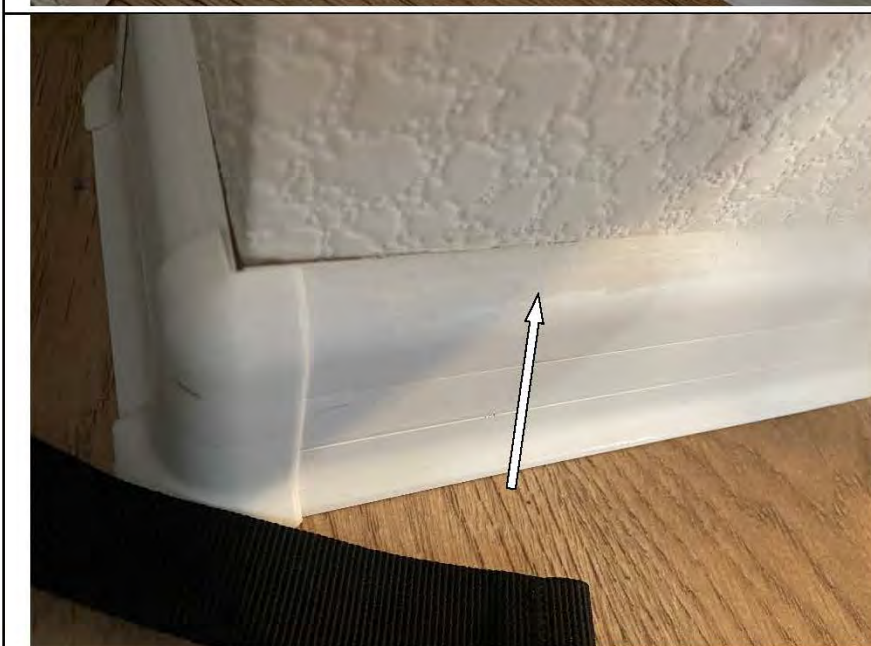
Фото №21. Дефект на напольном плинтусе ПВХ в кухне.
