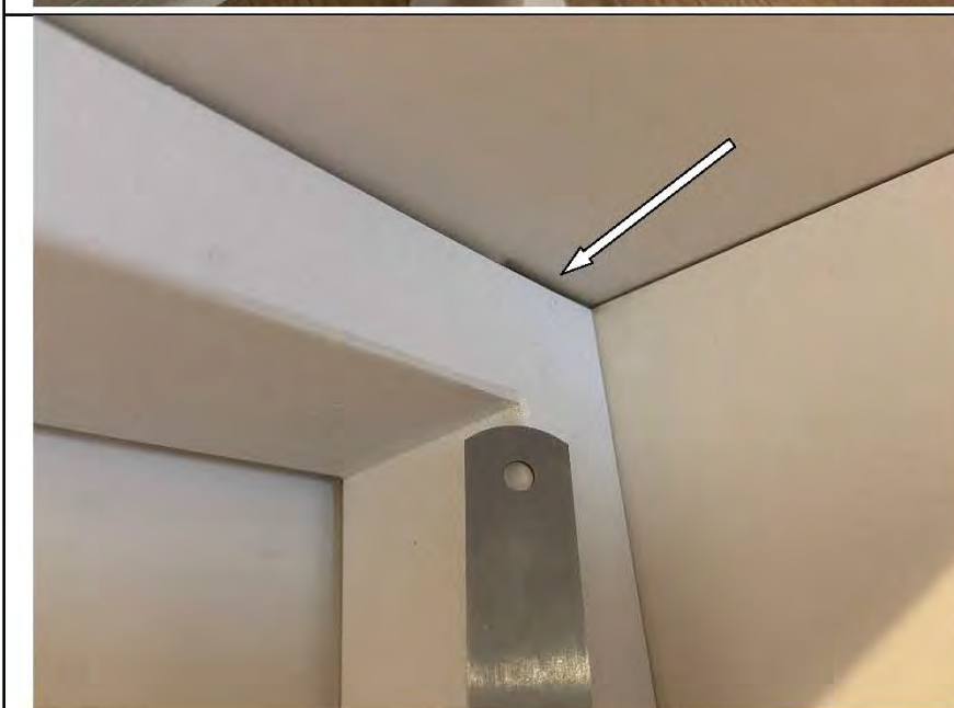
Фото №45. Дефект на коробке входного дверного блока в коридоре.
