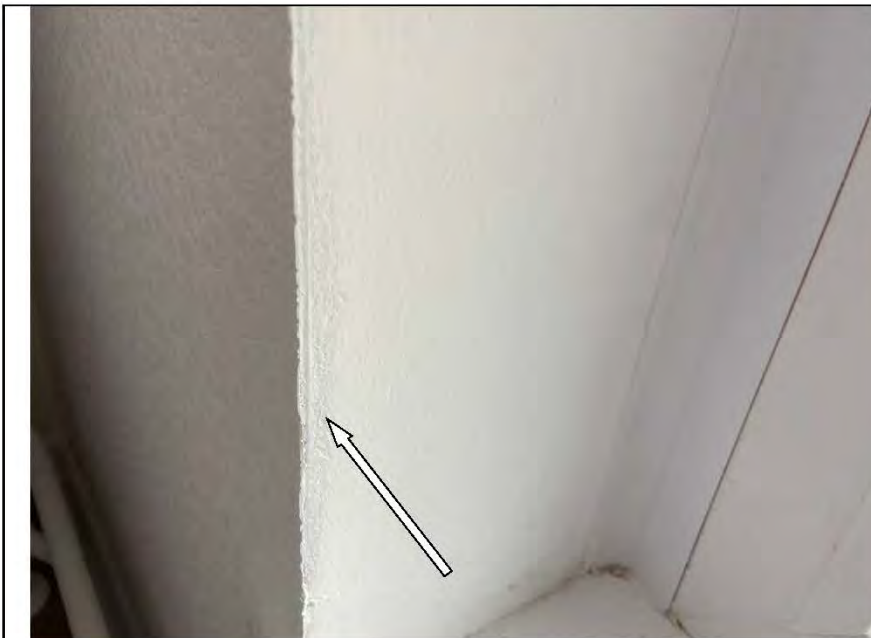
Фото №37. Неровности, выбоины, раковины на окрашенных откосах оконного блока ПВХ в кухне.
