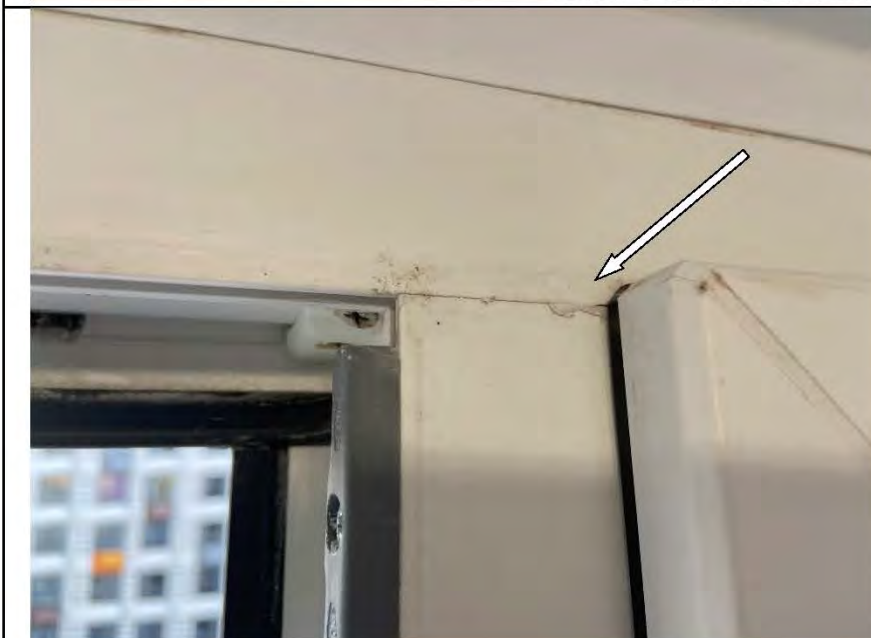
Фото №32. Дефект на профиле оконного блока ПВХ в кухне.
