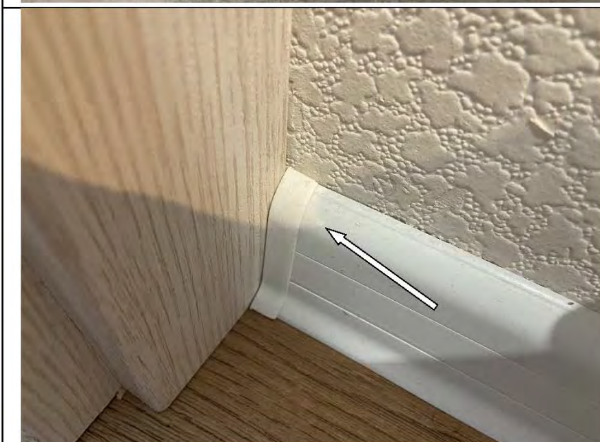
Фото №20. Дефект на напольном плинтусе ПВХ в коридоре.
