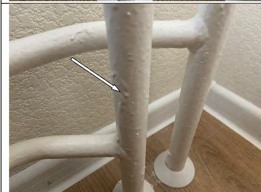
Фото №44. Неровности, подтеки, раковины на окрашенных трубах отопления в спальне.
