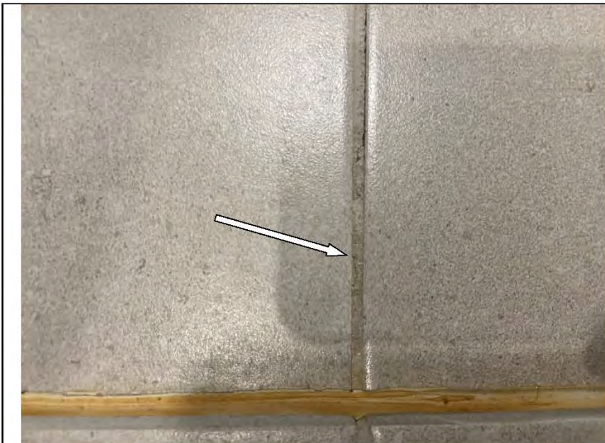
Фото №19. Неровные швы напольной керамической плитки в ванной комнате.
