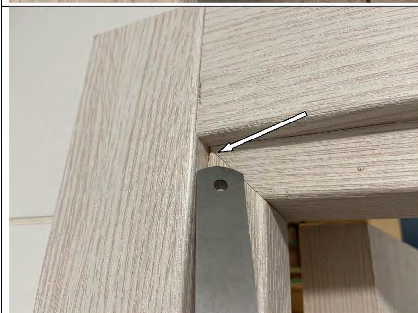
Фото №53. Дефект на коробке деревянного дверного блока в ванной комнате.
