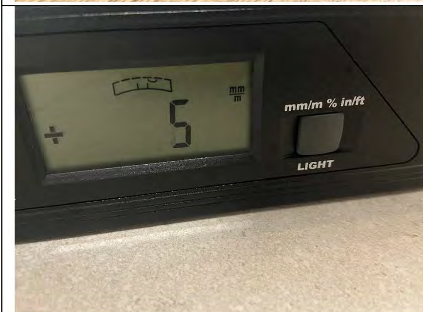
Фото №17. Отклонение поверхности напольного покрытия из керамической плитки в ванной комнате.
