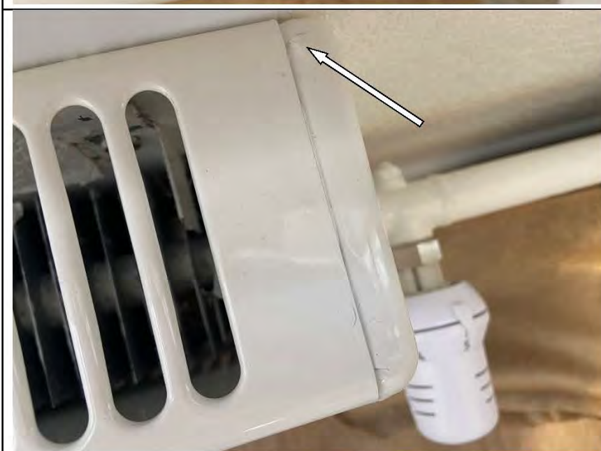
Фото №63. Дефект на поверхности металлического кожуха отопительного прибора в спальне.
