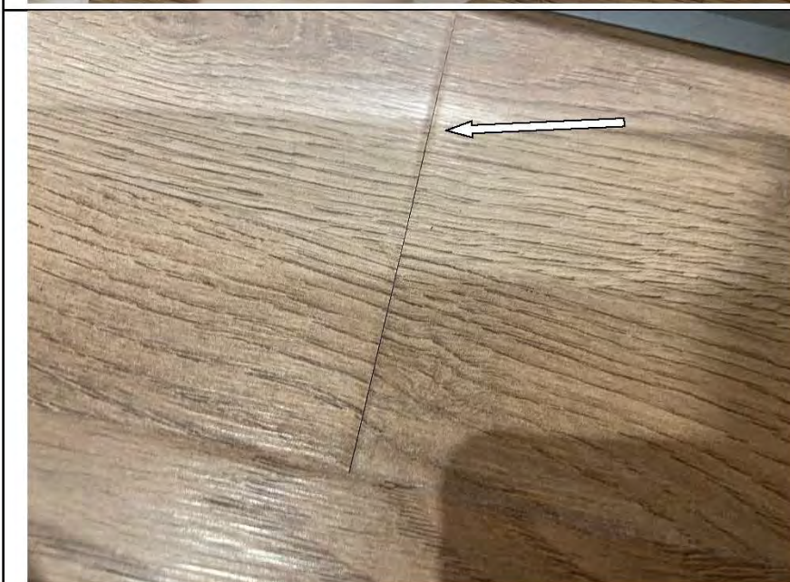
Фото №26. Поднятые кромки досок ламината в коридоре.
