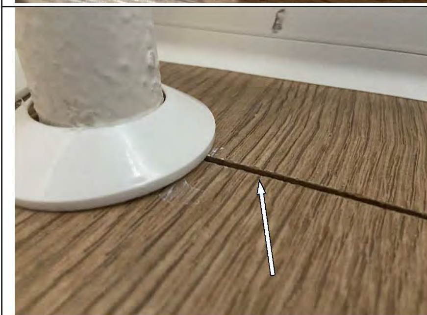
Фото №27. Поднятые кромки досок ламината в кухне.
