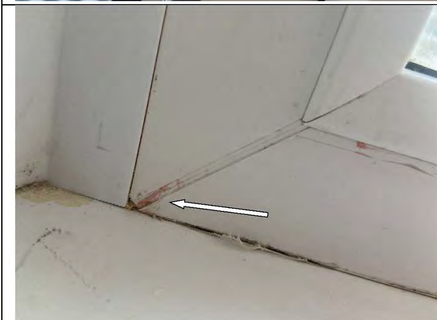
Фото №33. Дефект на профиле оконного блока ПВХ в спальне.
