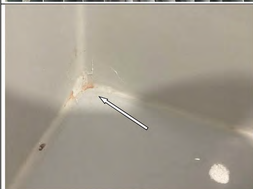
Фото №66. Загрязнения на ванне в ванной комнате.
