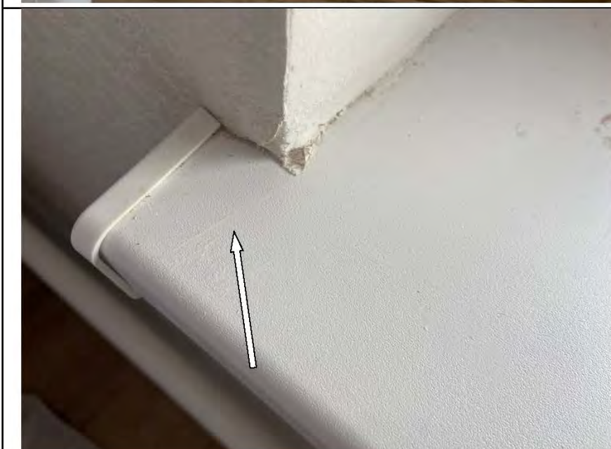
Фото №30. Дефект на лицевой стороне подоконной доски в кухне.
