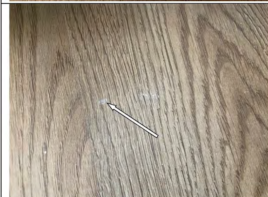
Фото №23. Дефект на поверхности напольного покрытия из ламината в кухне.
