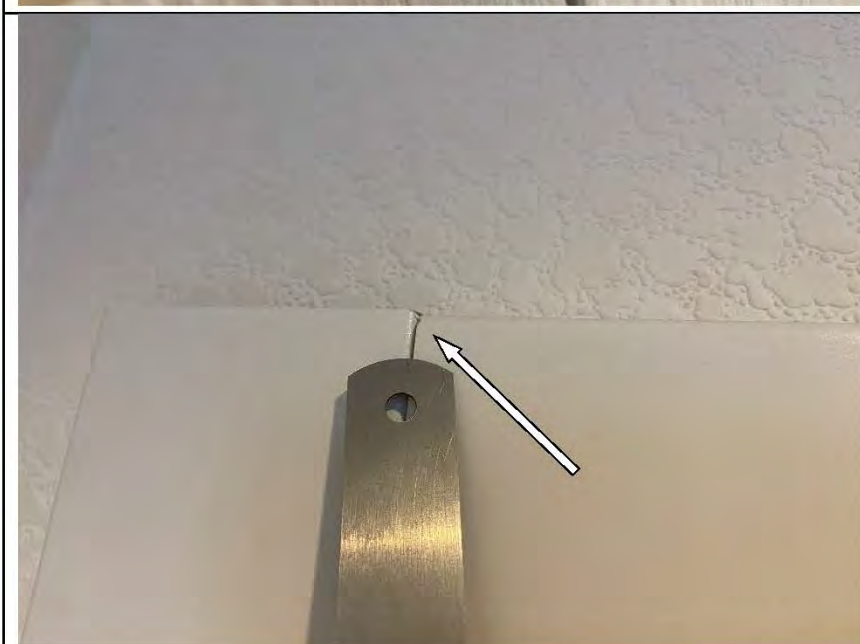
Фото №50. Дефект на наличниках входного дверного блока в коридоре.
