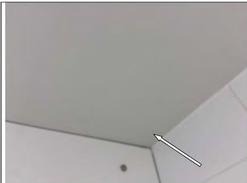
Фото №61. Дефект на поверхности подвесного потолка в ванной комнате.
