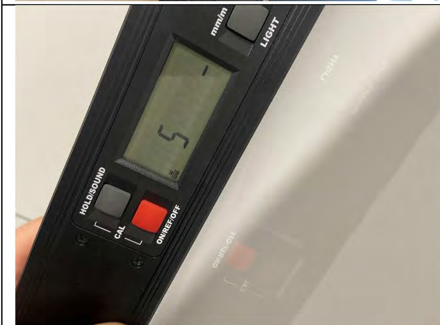
Фото №9. Отклонение поверхности стен от вертикали в ванной комнате.
