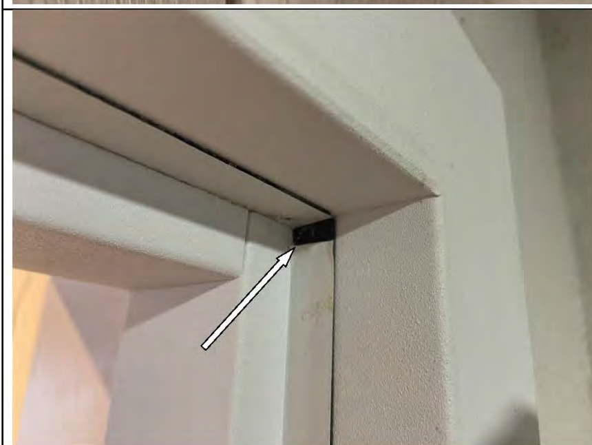
Фото №57. Дефект на уплотнительной противопожарной ленте входного дверного блока в коридоре.
