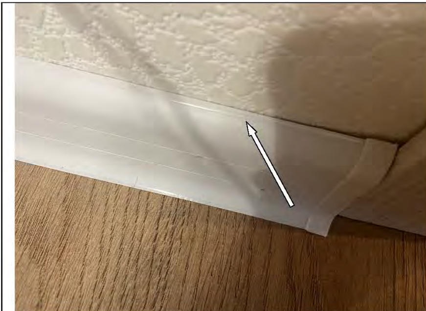
Фото №22. Дефект на напольном плинтусе ПВХ в спальне.
