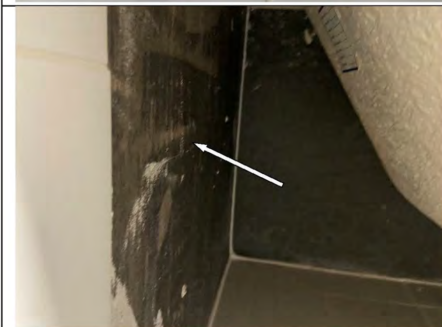
Фото №12. Частично отсутствует настенная керамическая плитка в ванной комнате.
