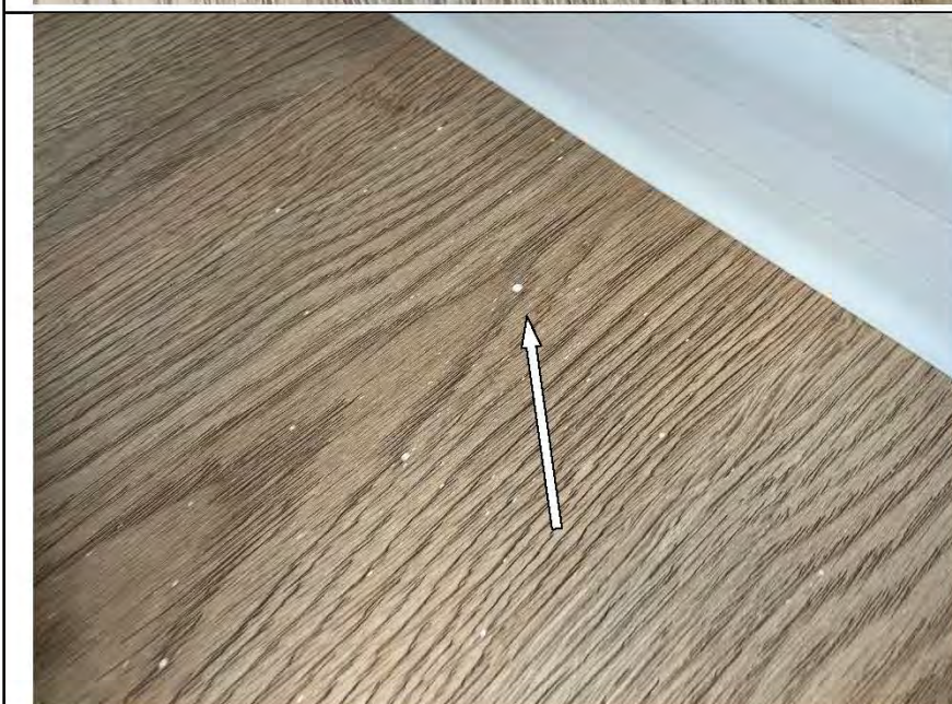
Фото №24. Дефект на поверхности напольного покрытия из ламината в коридоре.
