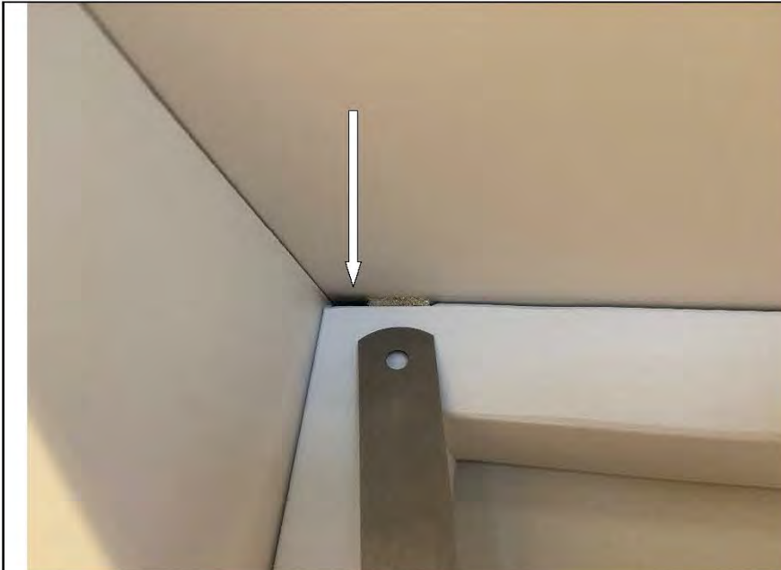
Фото №46. Дефект на коробке входного дверного блока в коридоре.
