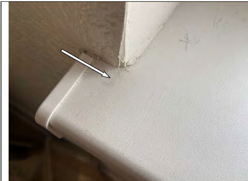
Фото №31. Дефект на лицевой стороне подоконной доски в спальне.
