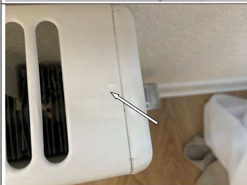
Фото №62. Дефект на поверхности металлического кожуха отопительного прибора в кухне.
