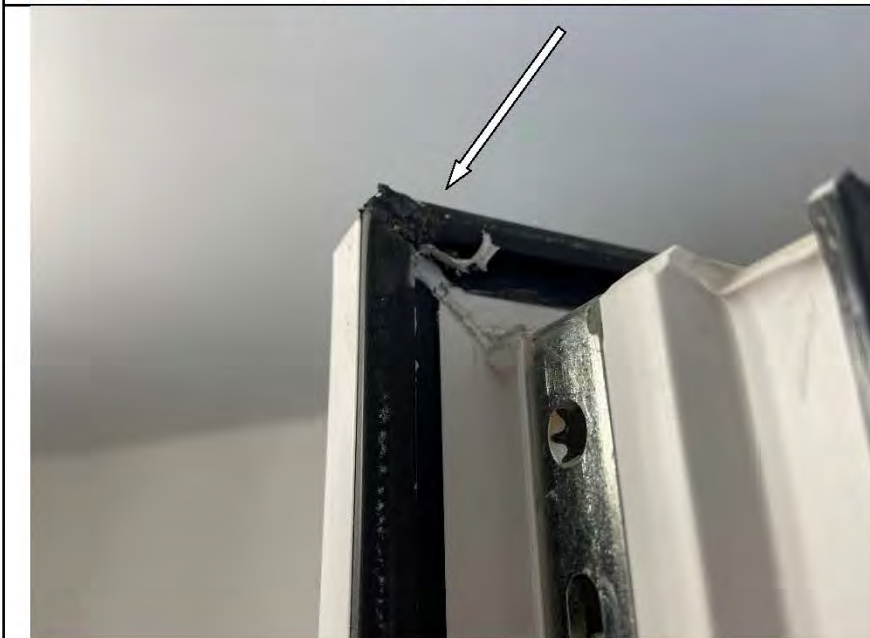
Фото №41. Дефект на уплотнительной ленте оконного блока ПВХ в кухне.
