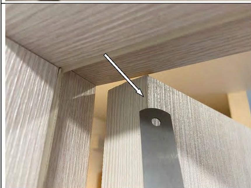
Фото №48. Дефект на полотне деревянного дверного блока в ванной комнате.
