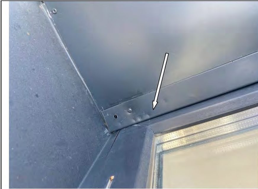
Фото №22. Механические повреждения на металлическом отливе оконного блока ПВХ.
