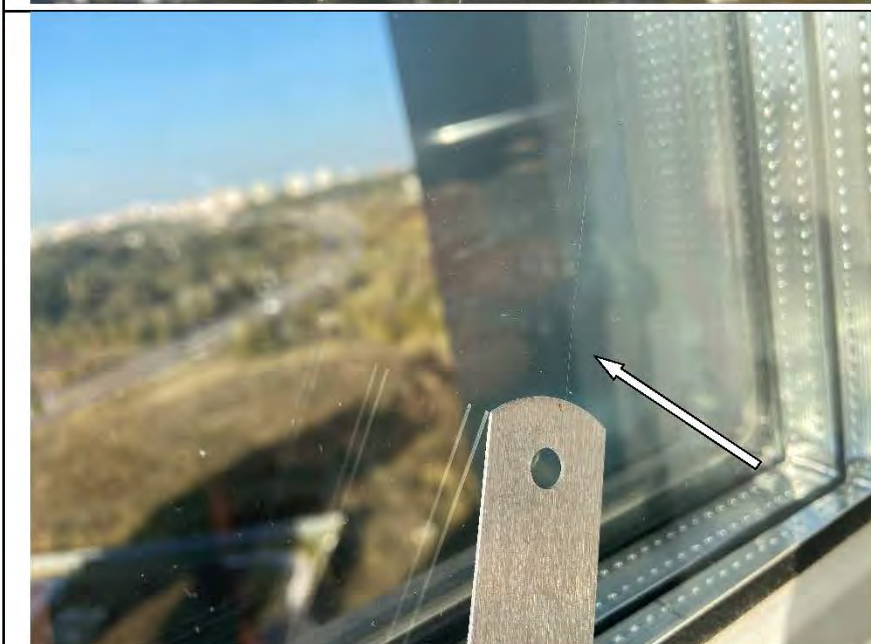
Фото №20. Царапина на стеклопакете оконного блока ПВХ в помещении.
