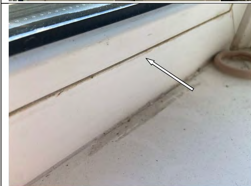
Фото №9. Дефекты на профиле оконного блока ПВХ в помещении.
