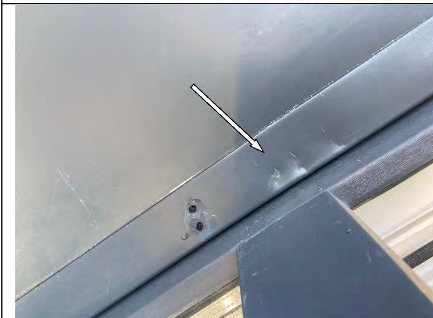
Фото №23. Механические повреждения на металлическом отливе оконного блока ПВХ.
