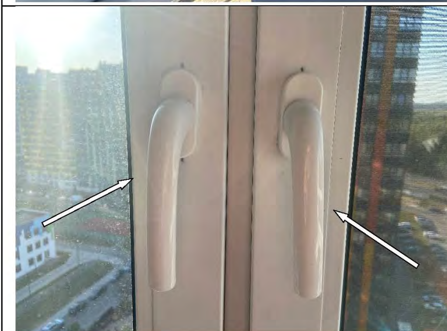
Фото №24. Не отрегулирована фурнитура оконного блока ПВХ в помещении.
