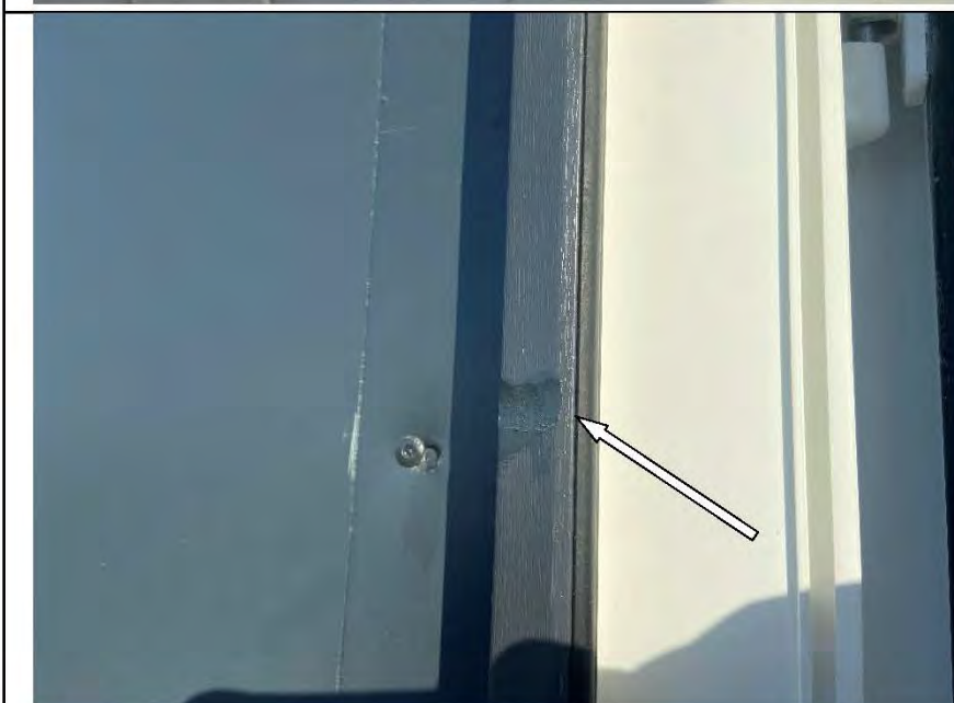
Фото №11. Дефекты на профиле оконного блока ПВХ в помещении.
