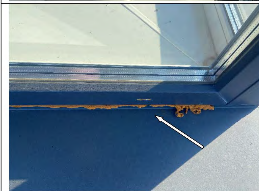
Фото №14. Узел оконного блока ПВХ выполнен с нарушениями.
