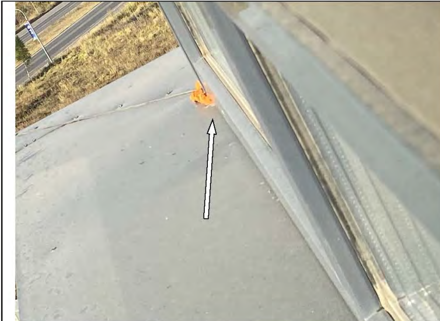
Фото №16. Узел оконного блока ПВХ выполнен с нарушениями.
