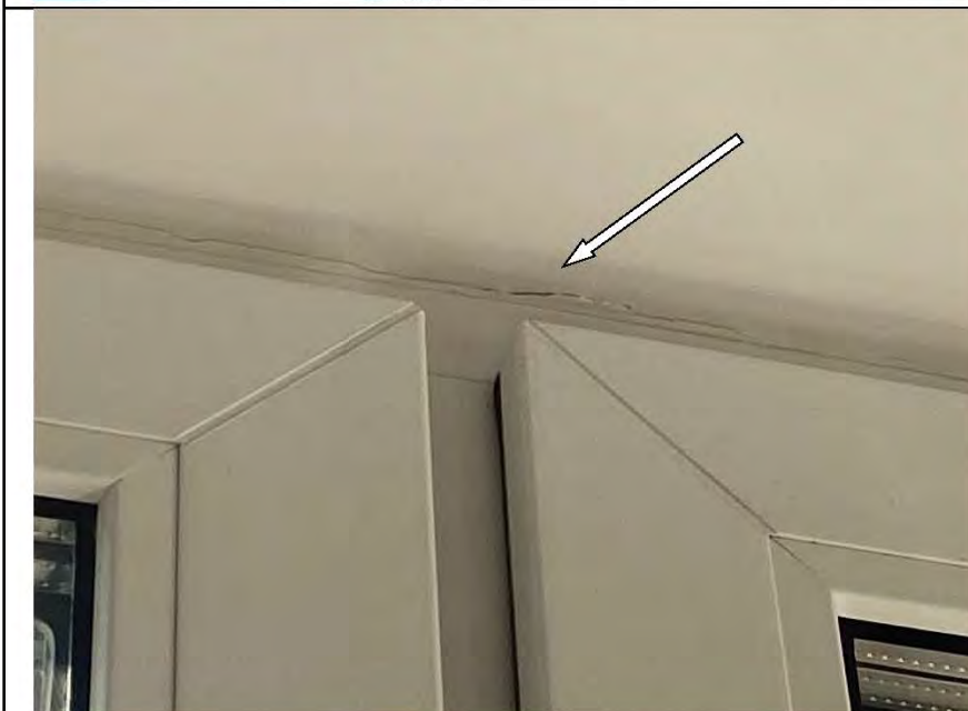
Фото №8. Инfiltrация воздуха и влаги оконного блока ПВХ в помещении.
