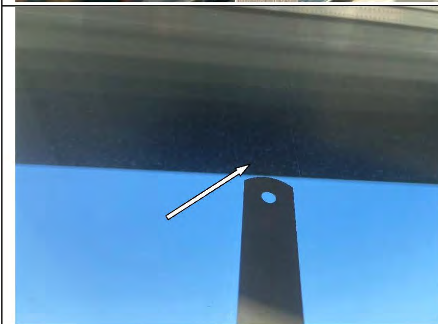
Фото №21. Царапина на стеклопакете оконного блока ПВХ в помещении.
