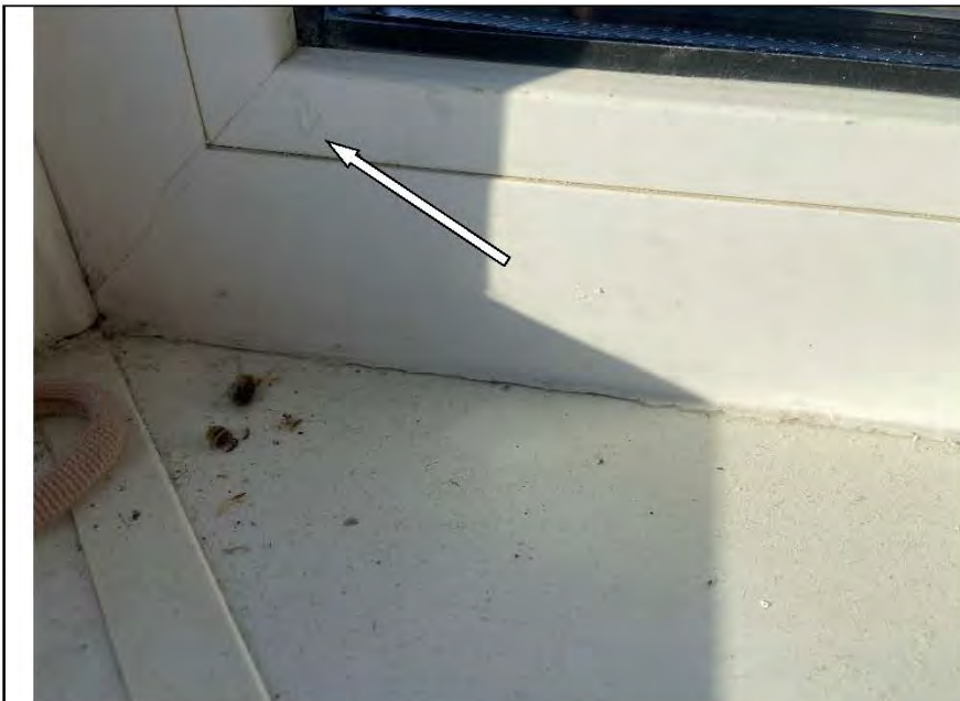
Фото №10. Дефекты на профиле оконного блока ПВХ в помещении.
