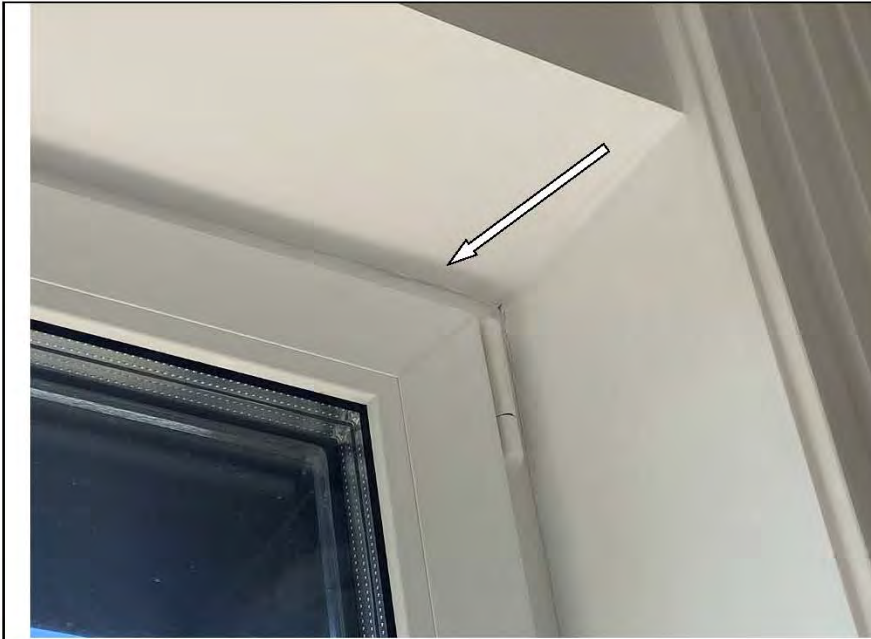
Фото №7. Инfiltrация воздуха и влаги оконного блока ПВХ в помещении.
