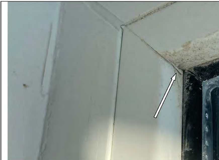
Фото №13. Дефекты на профиле оконного блока ПВХ в помещении.
