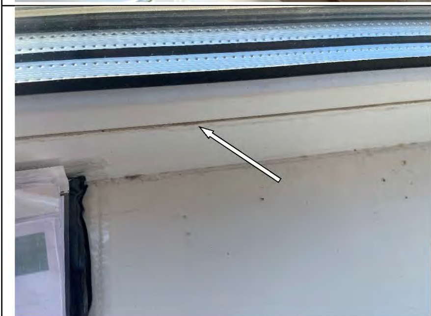
Фото №6. Инфильтрация воздуха и влаги оконного блока ПВХ в помещении.
