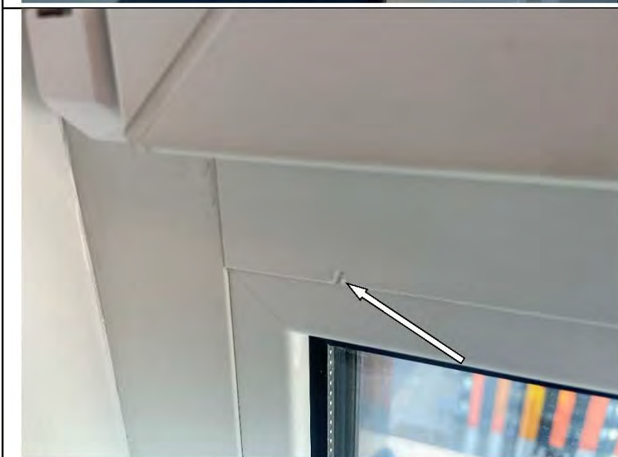
Фото №12. Дефекты на профиле оконного блока ПВХ в помещении.
