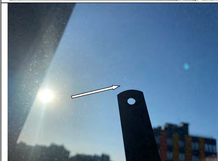
Фото №17. Царапина на стеклопакете оконного блока ПВХ в помещении.
