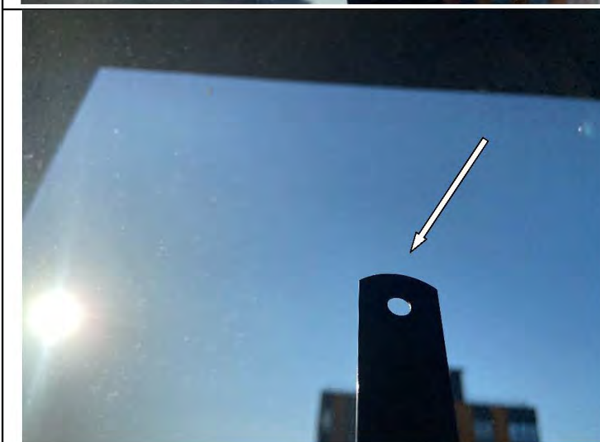
Фото №18. Царапина на стеклопакете оконного блока ПВХ в помещении.
