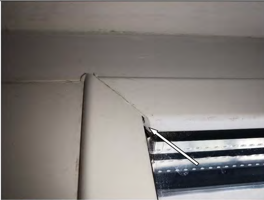
Фото №25. Зазоры профиля ПВХ оконного блока в комнате.
