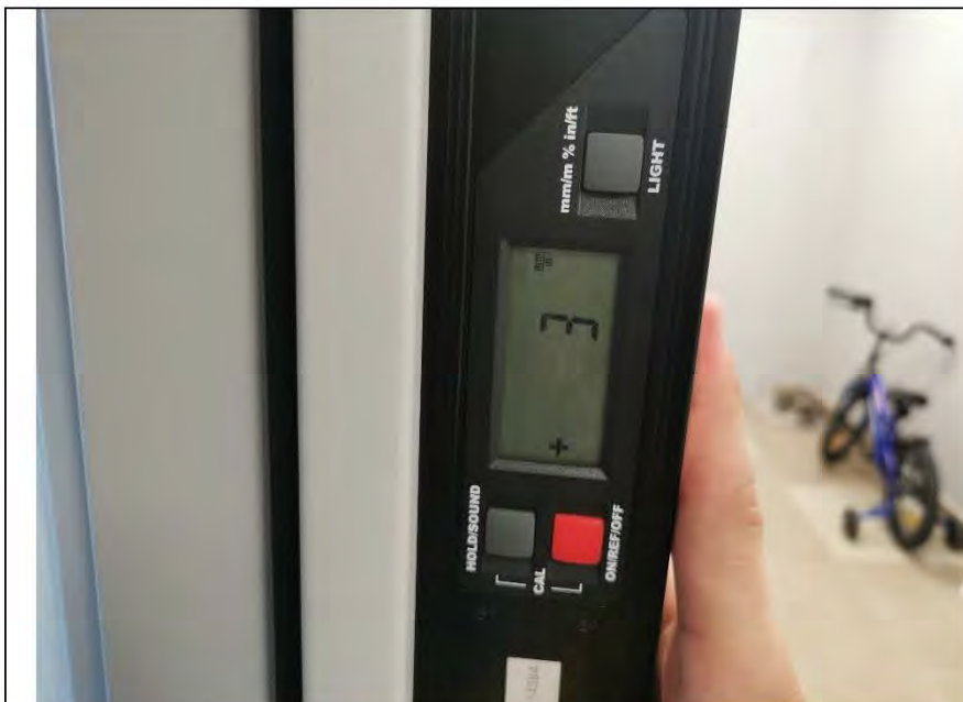
Фото №43. Отклонение коробки входного дверного блока составляет 3 мм.
