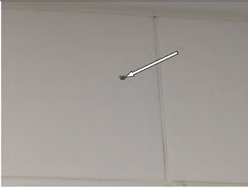
Фото №16. Загрязнение настенной керамической плитки в ванной комнате.
