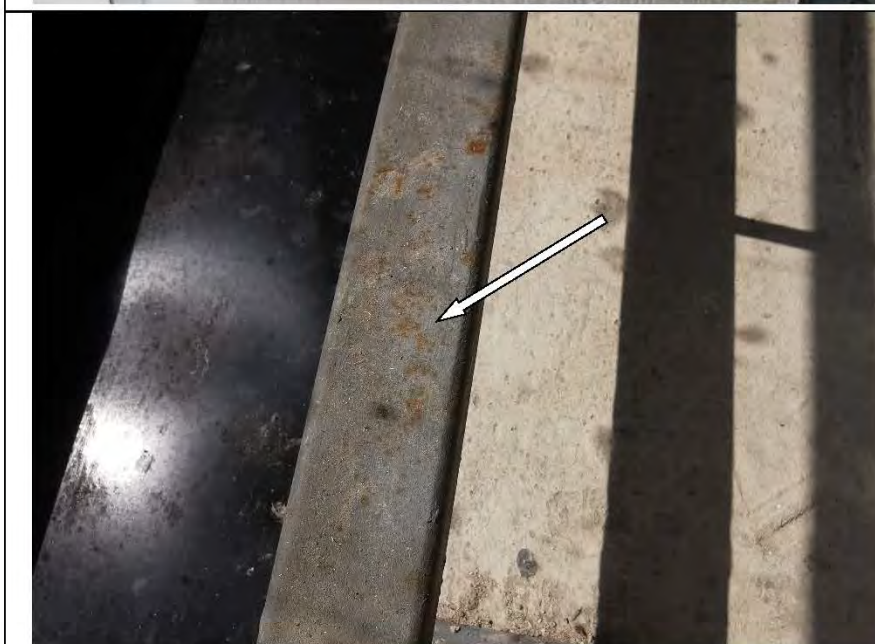
Фото №45. Коррозия на металлических ограждениях в лоджии.
