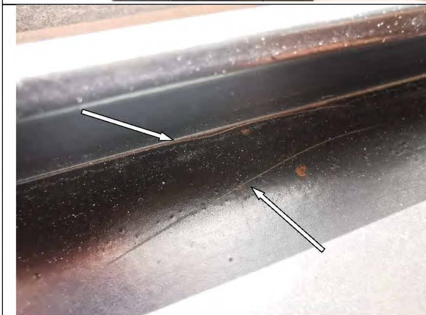
Фото №35. Царапины на профиле металлического оконного блока на лоджии.
