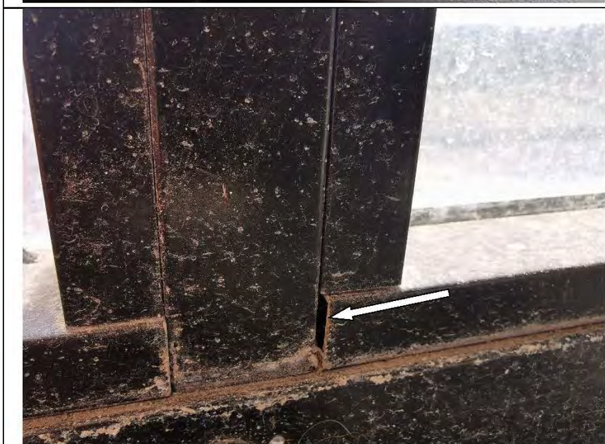
Фото №33. Зазор в месте соединения профилей металлического оконного блока на лоджии.
