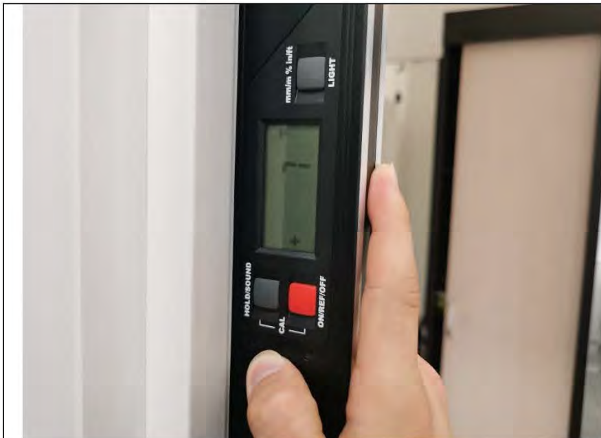
Фото №40. Отклонение коробки деревянного дверного блока от уровня вертикальности в ванной комнате.
