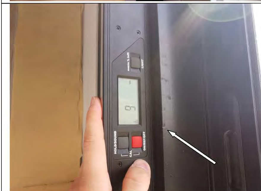
Фото №23. Отклонение металлического оконного блока на лоджии по уровню вертикальности.
