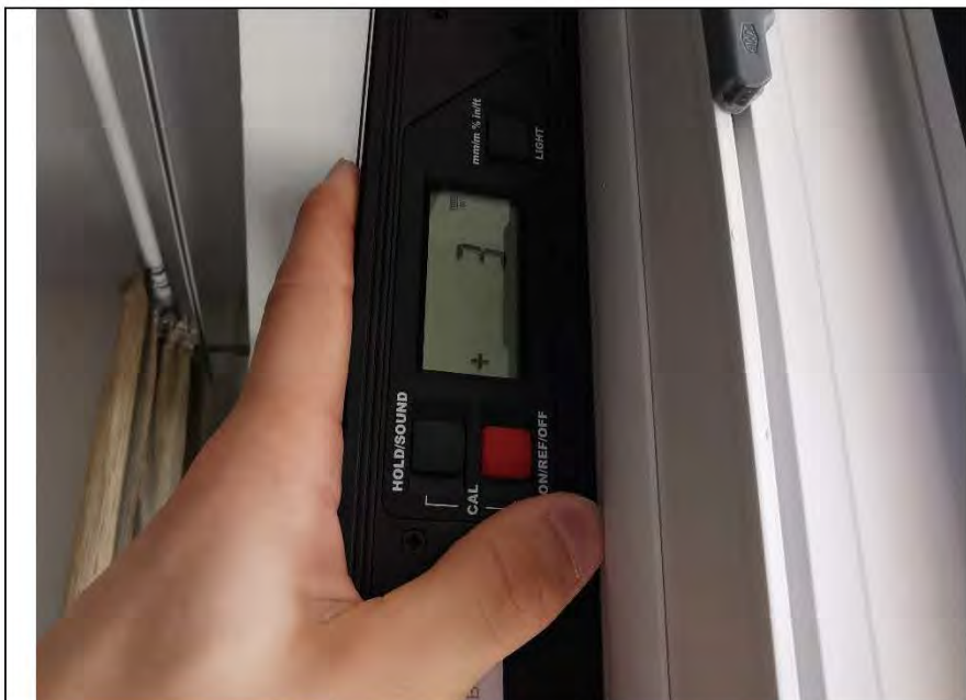
Фото №22. Отклонение ПВХ оконного блока в комнате по уровню вертикальности.
