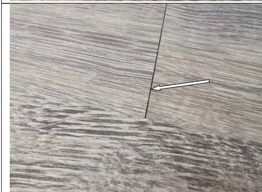
Фото №20. Поднятые кромки досок ламината в комнате.
