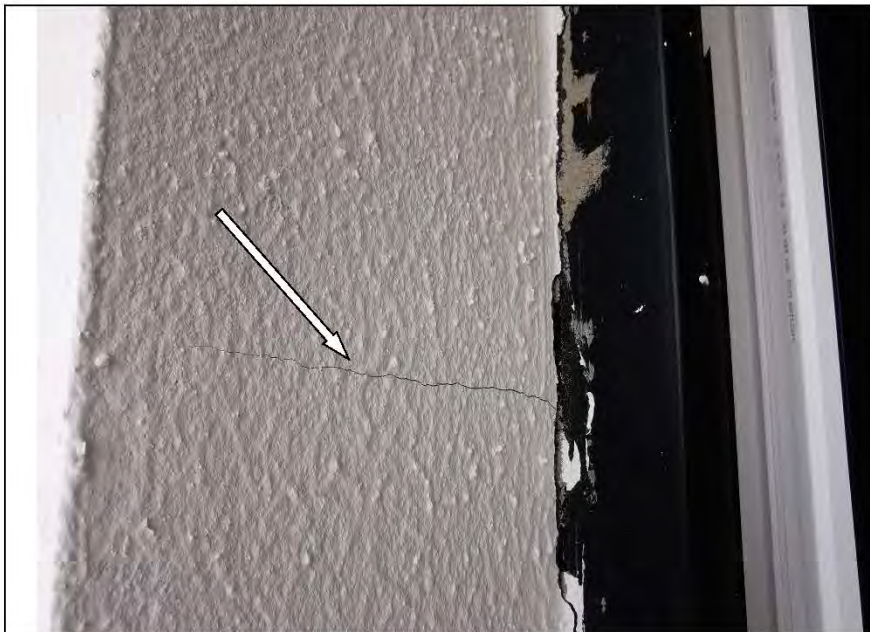
Фото №37. Трещины штукатурного слоя на откосах балконного дверного блока ПВХ.
