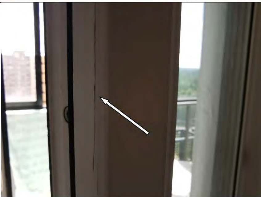
Фото №27. Царапины на профиле ПВХ дверного блока комнате.
