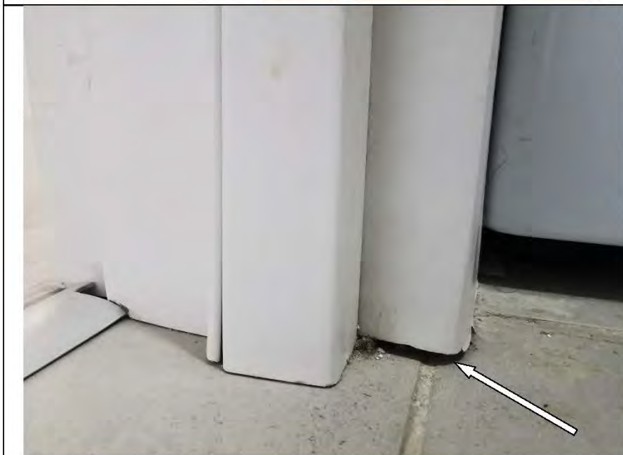
Фото №41. Коротко подрезан наличник деревянного дверного блока в ванной комнате.
