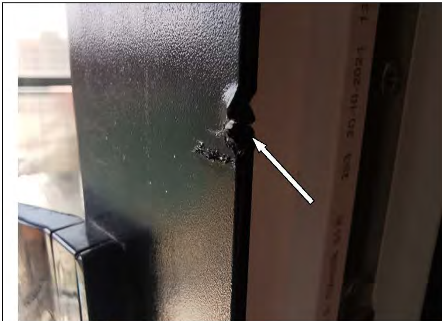
Фото №28. Замятие профиля ПВХ дверного блока в комнате.
