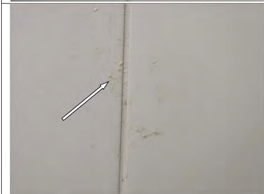
Фото №15. Загрязнение настенной керамической плитки в ванной комнате.
