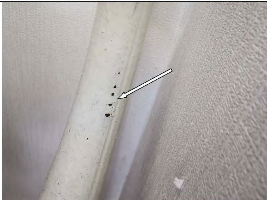
Фото №48. Некачественное окрашивание труб отопления в комнате.
