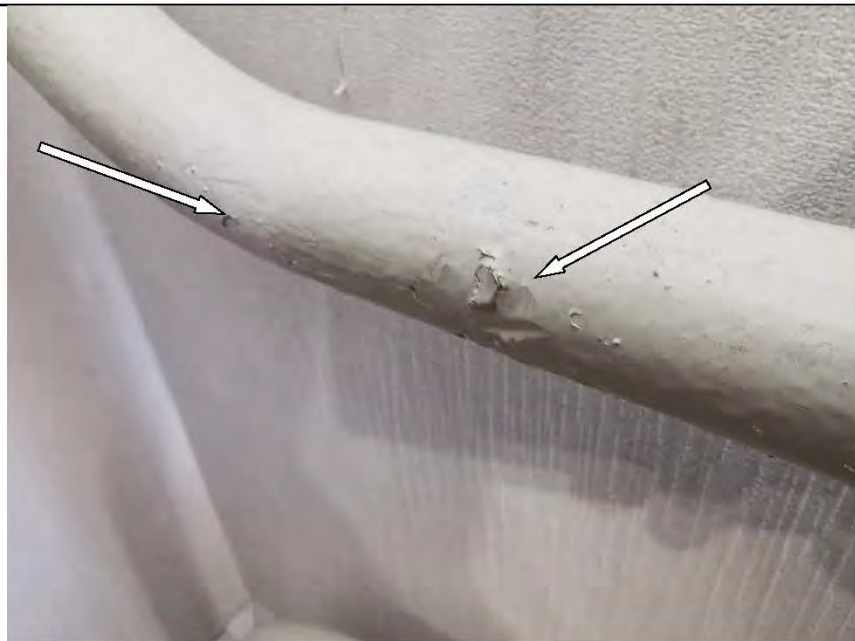
Фото №47. Некачественное окрашивание труб отопления в комнате.
