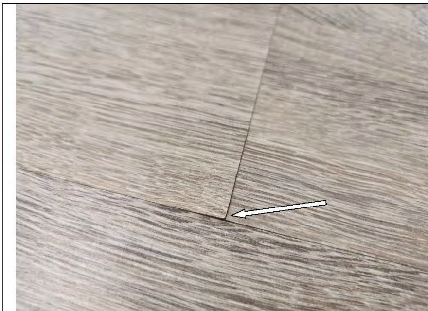
Фото №19. Поднятые кромки досок ламината в комнате.
