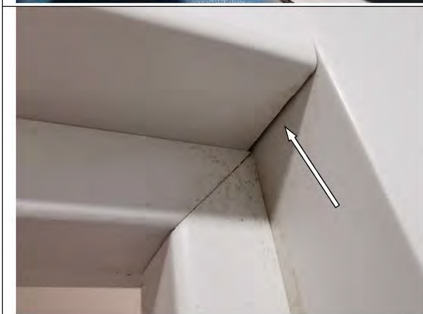
Фото №39. Ненадежное соединение элементов (наличников) деревянного дверного блока в ванной комнате.
