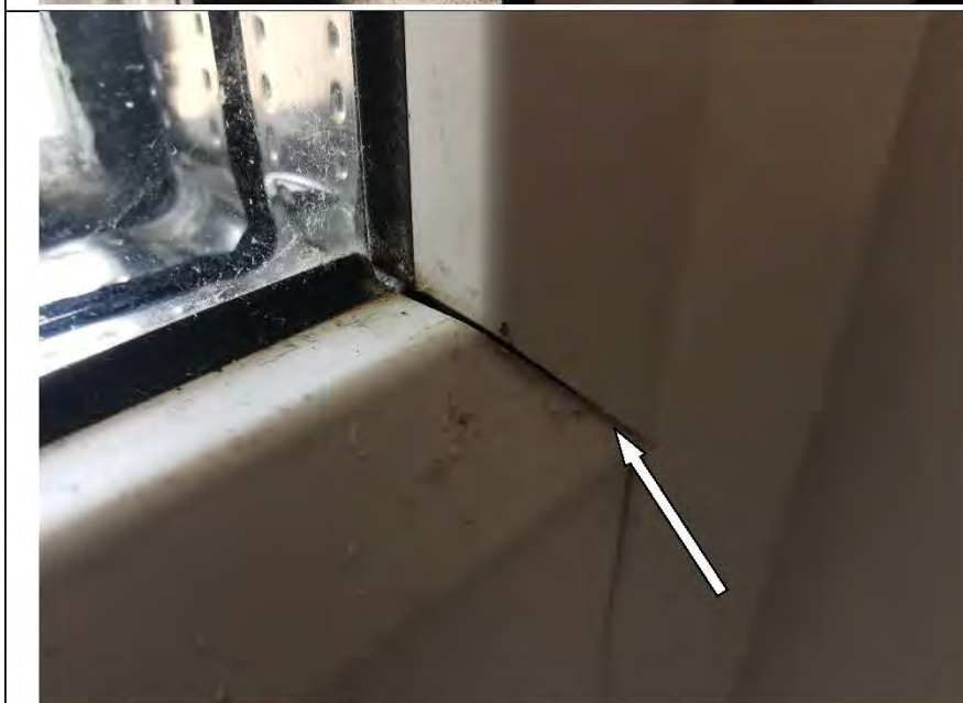
Фото №29. Зазоры профиля ПВХ дверного блока в комнате.
