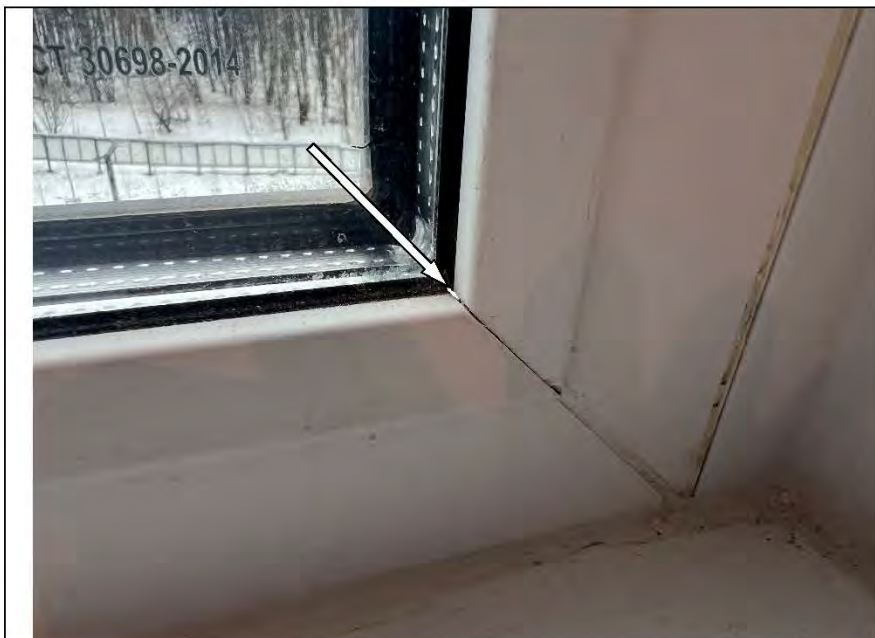
Фото №34. Зазор в стыке профилей ПВХ оконного блока в кухне.
