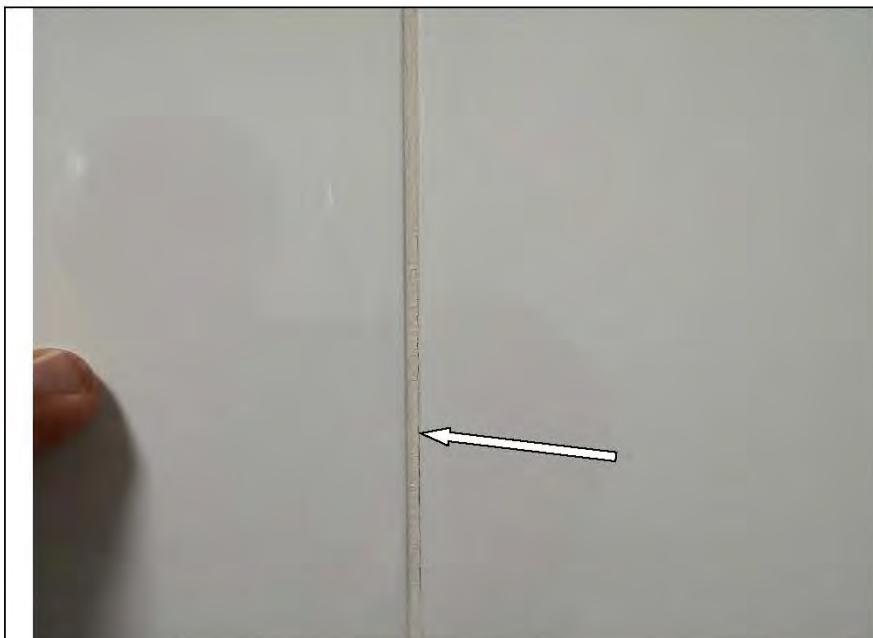
Фото №16. Трещина затирочного раствора в шовном пространстве настенной керамической плитки в ванной комнате.
