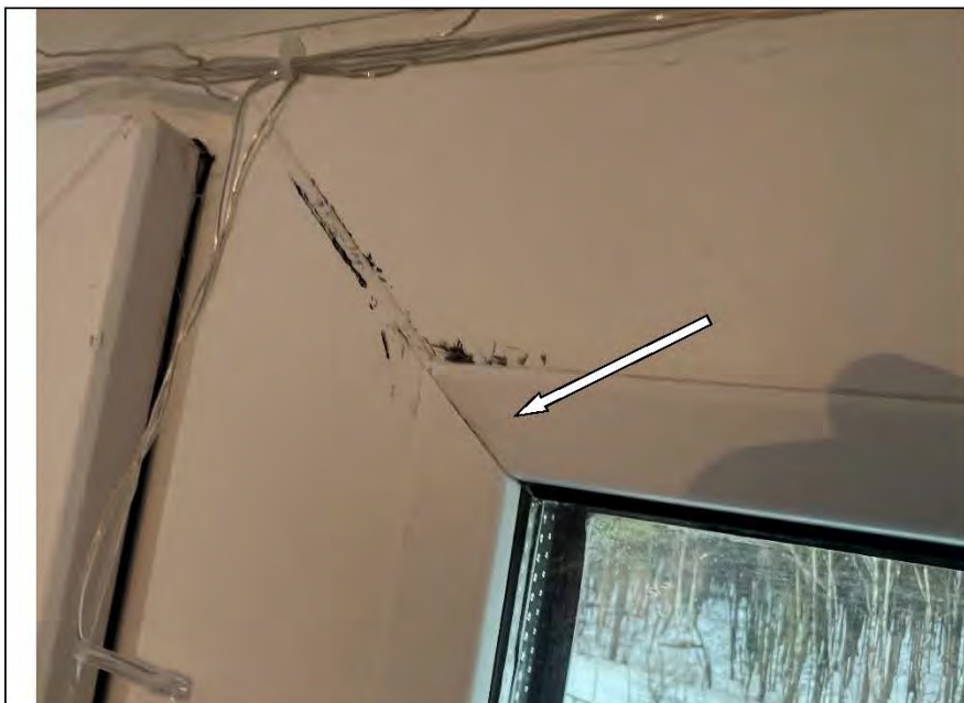
Фото №31. Зазор в стыке профилей ПВХ оконного блока в спальне.
