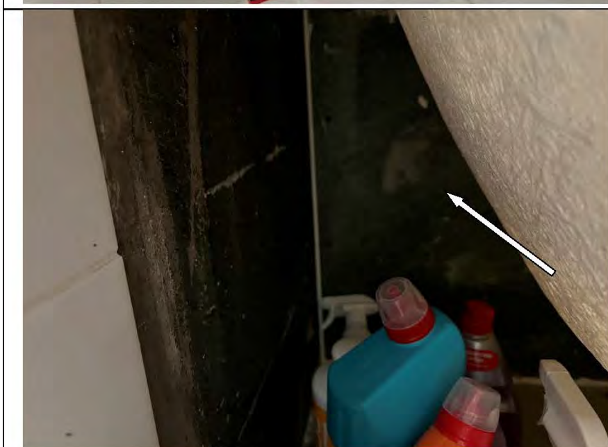
Фото №14. Отсутствует настенная керамическая плитка за ванной.
