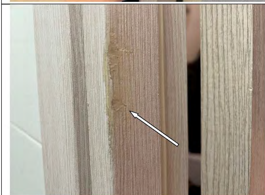
Фото №48. Скол на коробке деревянного дверного блока в ванной комнате.
