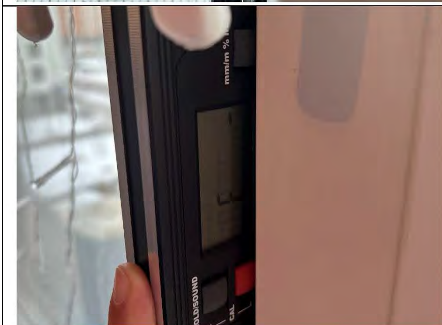
Фото №36. Отклонение оконного блока ПВХ по уровню вертикальности в спальне составляет 3 мм.
