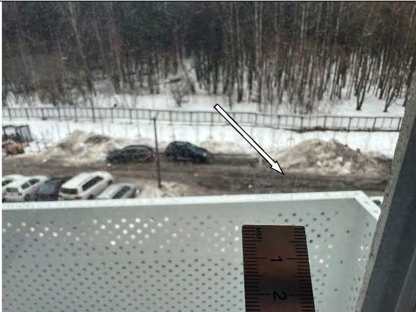
Фото №28. Царапина на стеклопакете оконного блока ПВХ в кухне.
