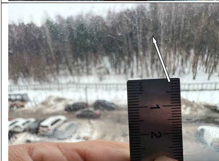
Фото №27. Царапина на стеклопакете оконного блока ПВХ в кухне.
