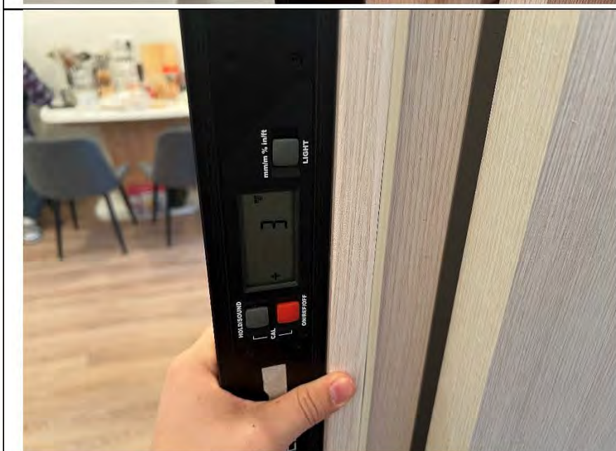
Фото №47. Отклонение коробки от плоскостности и прямолинейности дверного блока в спальне составляет 3 мм.
