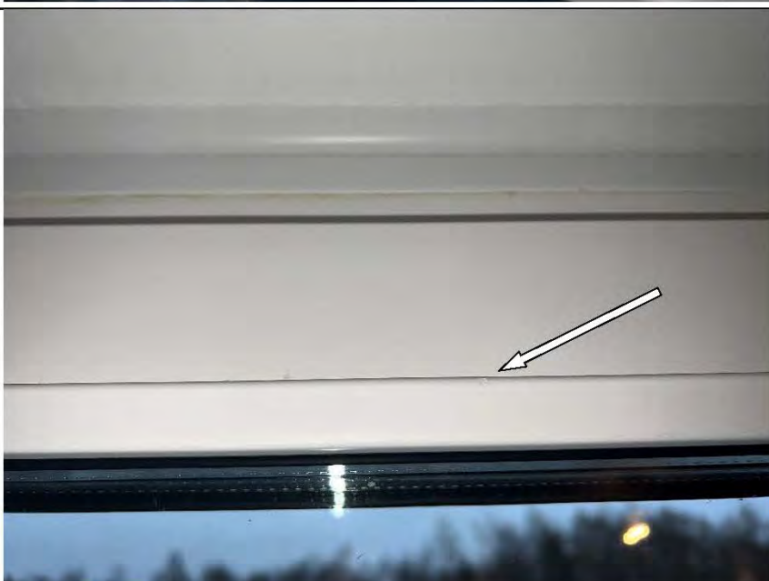
Фото №30. Скол на профиле ПВХ оконного блока в кухне.
