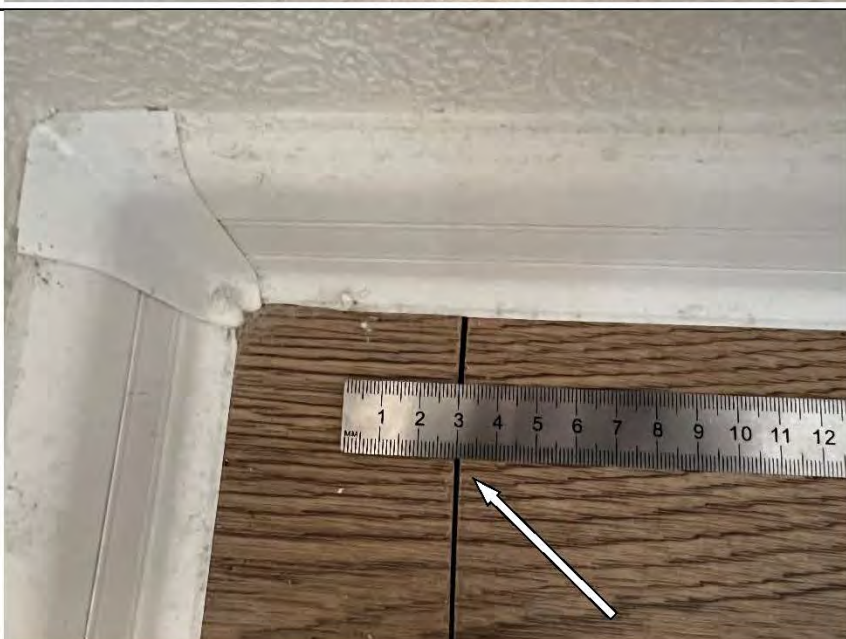
Фото №21. Зазор на стыке соседних досок ламината в спальне.
