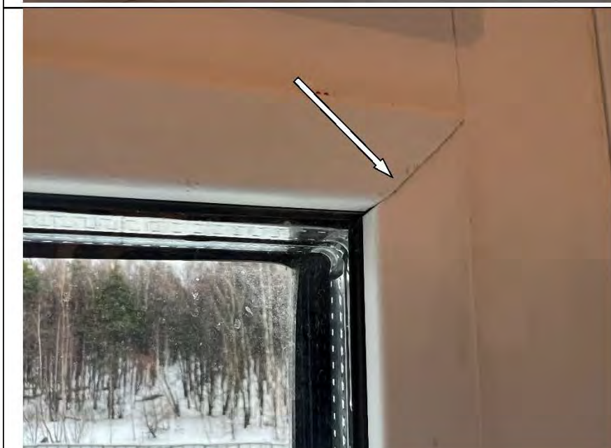
Фото №35. Зазор в стыке профилей ПВХ оконного блока в кухне.
