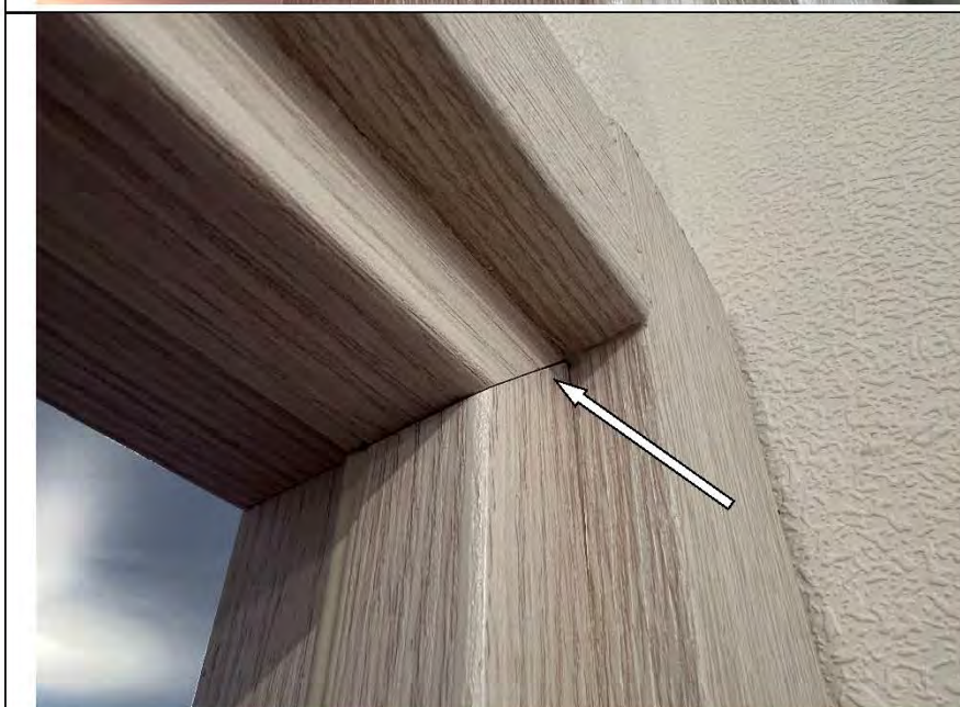
Фото №45. Элементы дверного блока соединены не надежно в спальне.
