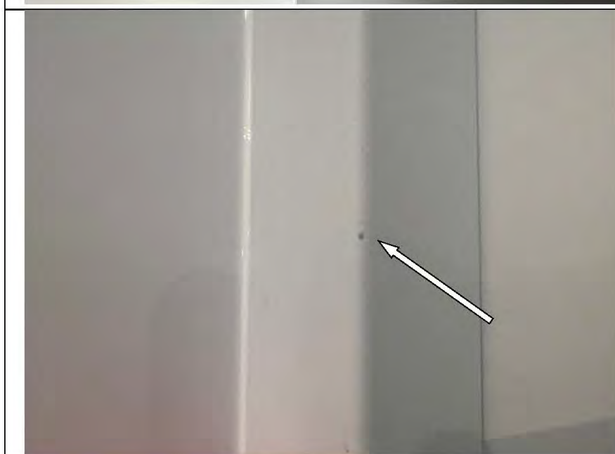
Фото №42. Скол на коробке входного дверного блока.
