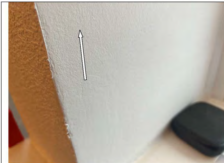
Фото №25. Подтеки краски по отколу оконного блока ПВХ в кухне.
