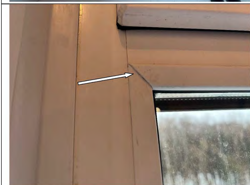
Фото №33. Зазор в стыке профилей ПВХ оконного блока в кухне.
