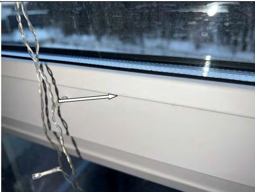
Фото №29. Скол на профиле ПВХ оконного блока в спальне.
