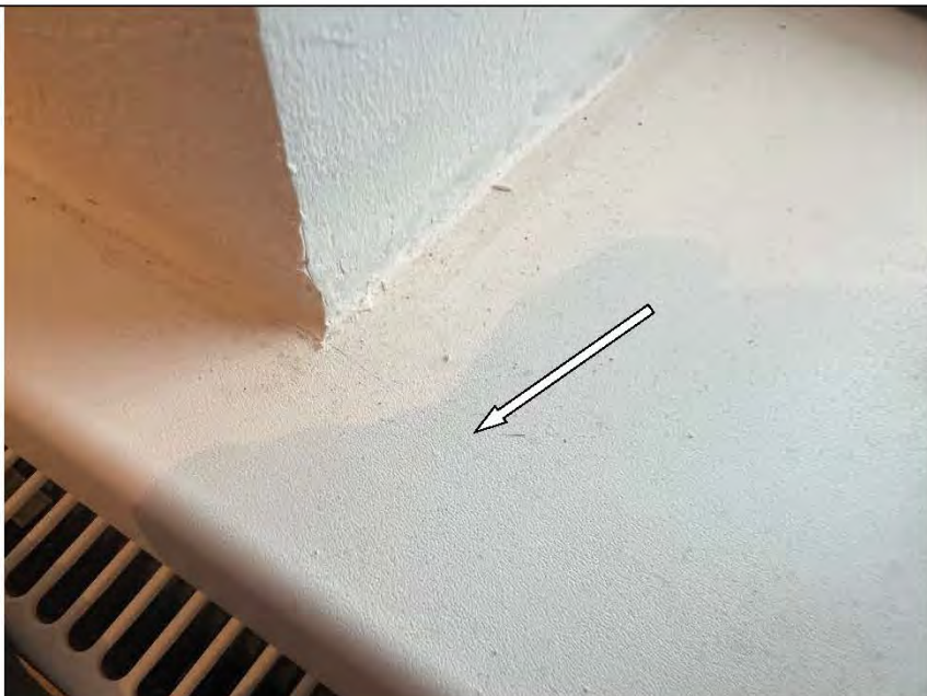
Фото №22. Царапина на лицевой поверхности подоконной доски в кухне.
