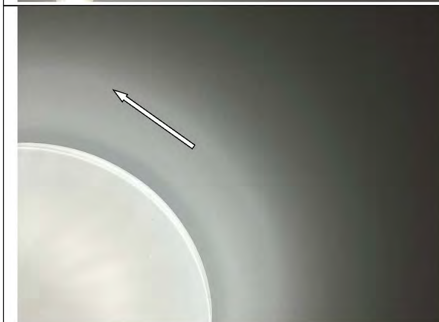
Фото №41. Загрязнение поверхности потолка в ванной комнате.
