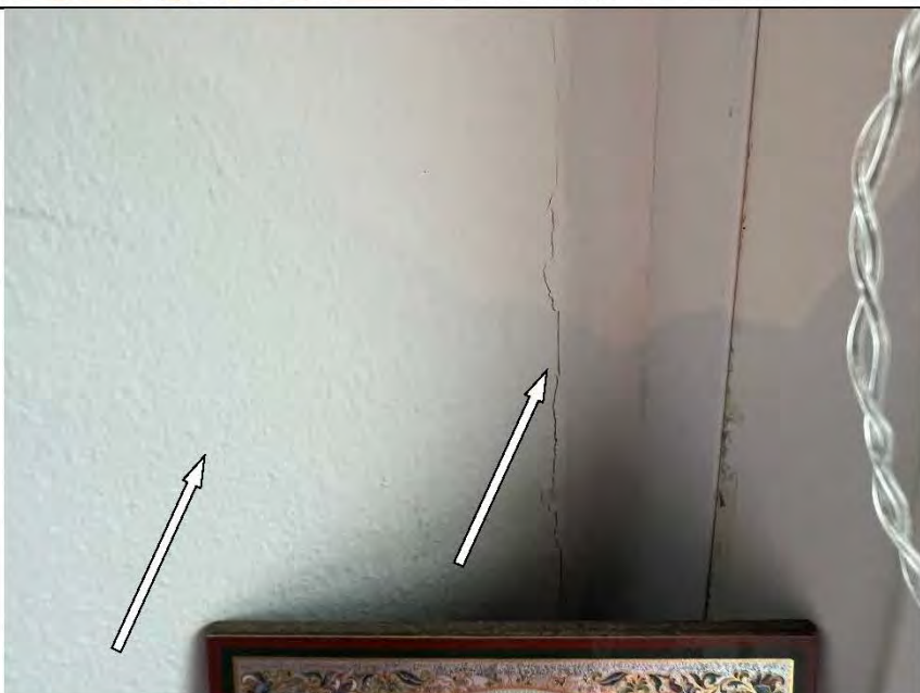
Фото №23. Трещина и подтеки краски по отколу оконного блока ПВХ в спальне.
