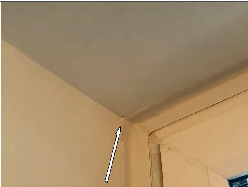
Фото №24. Трещина по отколу оконного блока ПВХ в кухне.
