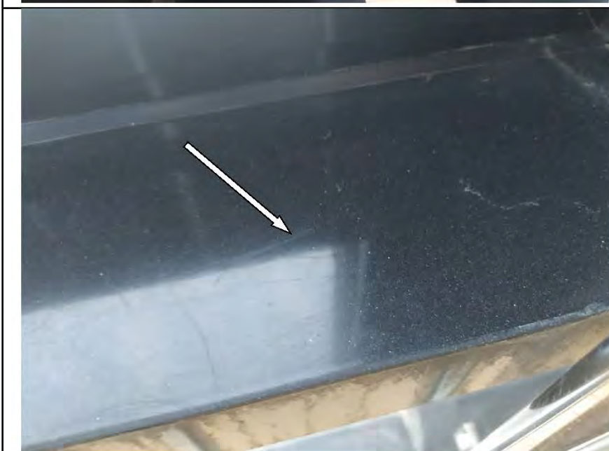
Фото №33. Профиль оконного блока в спальне имеет дефекты (загрязнение малярными составами).
