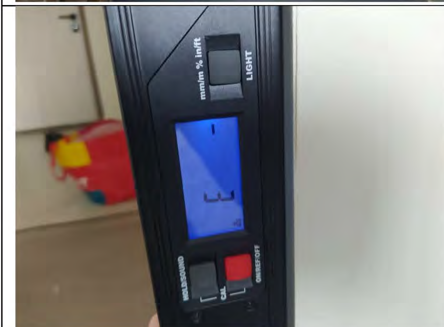
Фото №44. Отклонение коробки дверного блока в гостиной.
