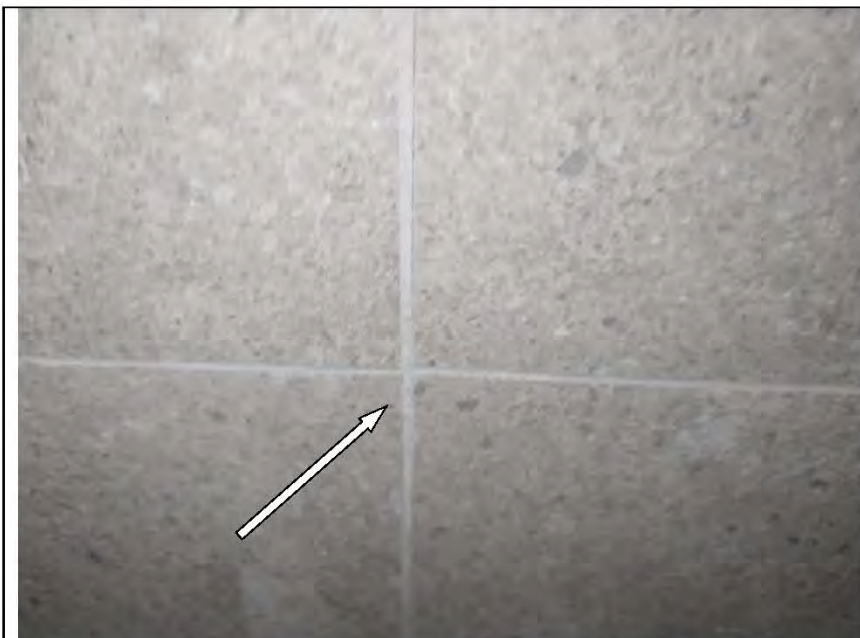
Фото №55. Затирка настенной плитки в санузле выполнена с нарушениями (разность ширины шва).
