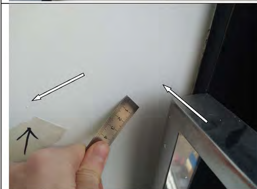
Фото №24. Окрашенные откосы оконного блока в гостиной выполнены с дефектами (брызги, трещины).
