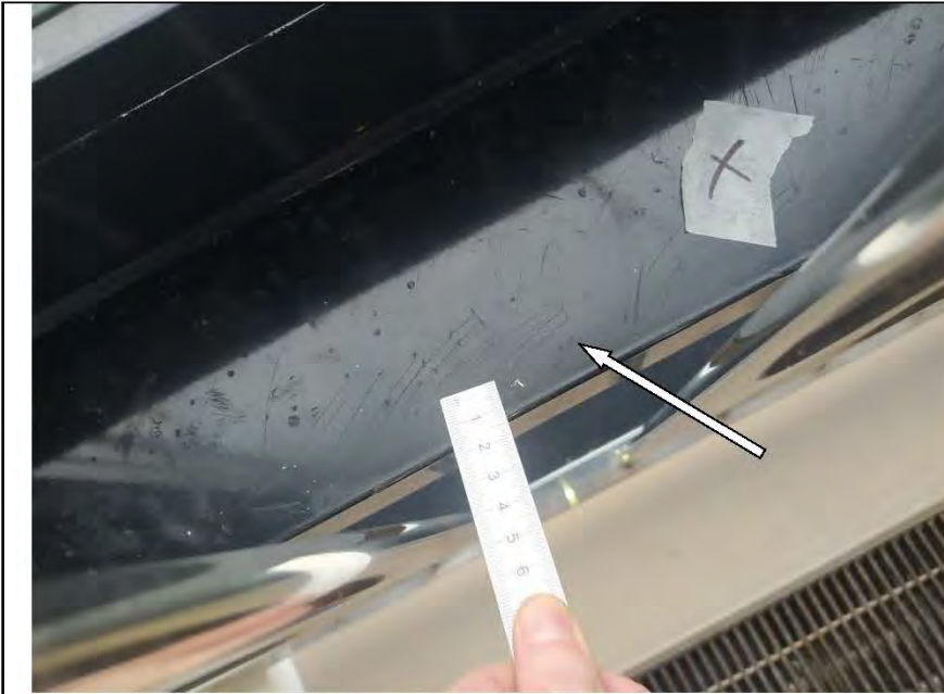
Фото №34. Профиль оконного блока в гостиной имеет дефекты (царапины).
