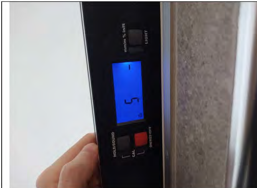
Фото №46. Отклонение коробки дверного блока в санузле.
