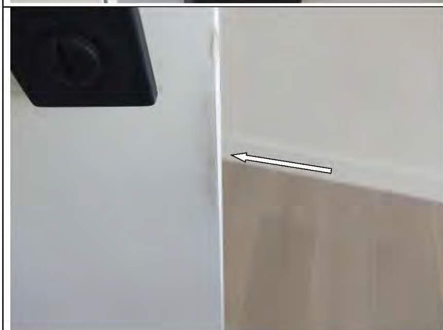
Фото №51. Дефекты (протертости) на лицевой поверхности полотна деревянного дверного блока в спальне.
