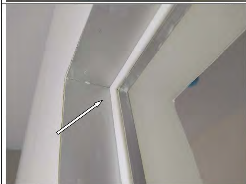
Фото №48. Коробка деревянного дверного блока в спальне имеет дефекты (загрязнение малярными составами).
