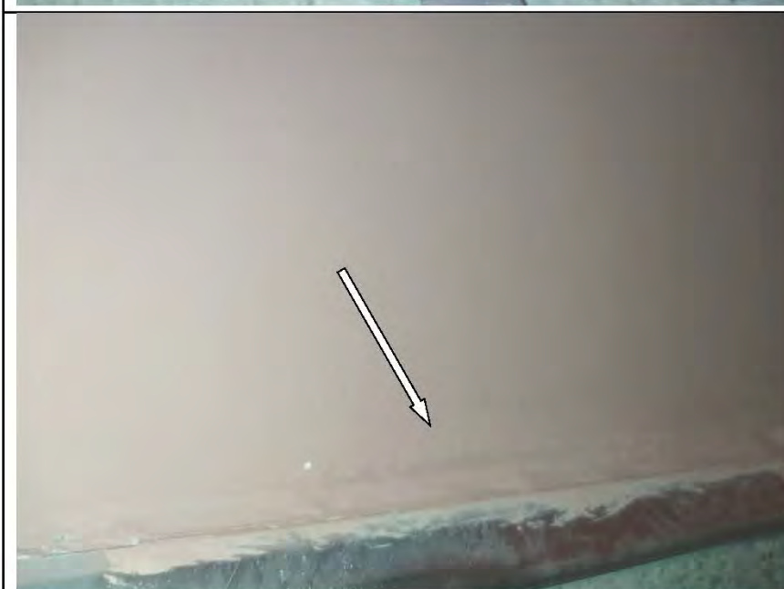
Фото №57. Окрашенные стены в ванной комнате выполнены с дефектами (полосы, следы от инструмента)
