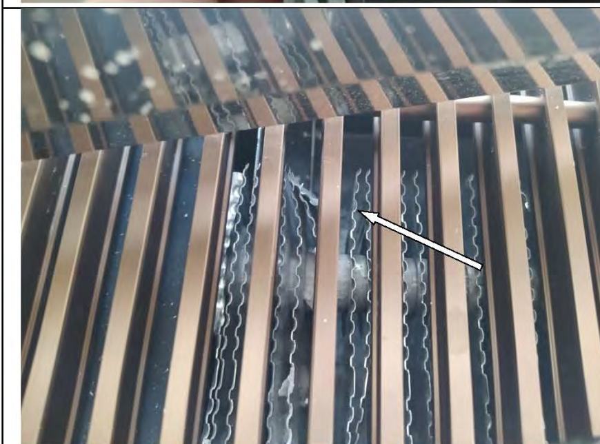
Фото №39. Радиатор №1 в кухне имеет дефекты (замятия)
