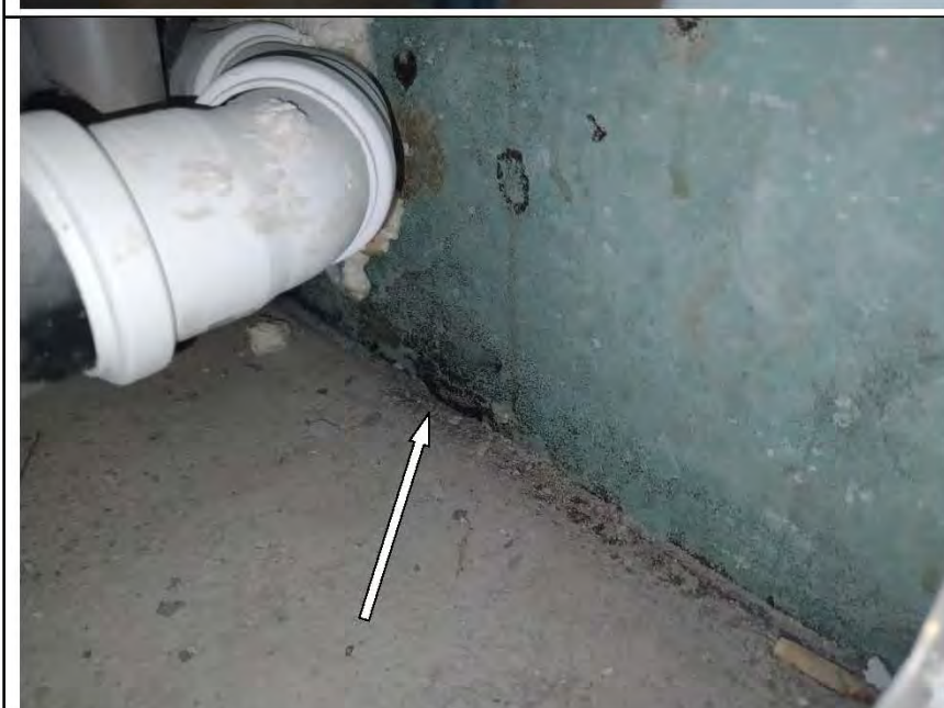
Фото №66. Отсутствие гидроизоляции в санузле. Следы поражения грибком.
