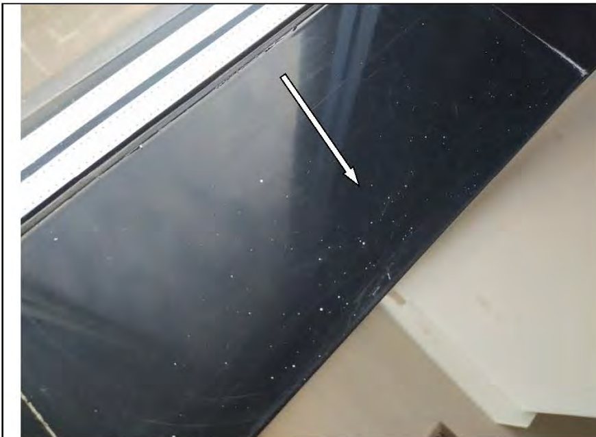
Фото №31. Профиль оконного блока №3 в кухне имеет дефекты (загрязнение малярными составами).
