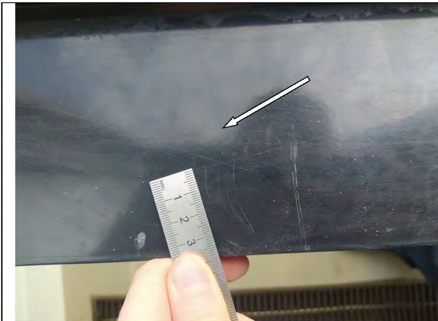
Фото №28. Профиль оконного блока №2 в кухне имеет дефекты (царапины).
