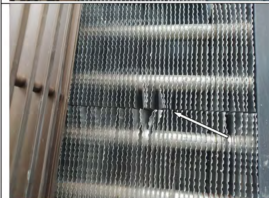
Фото №41. Радиатор №3 в кухне имеет дефекты (замятия)
