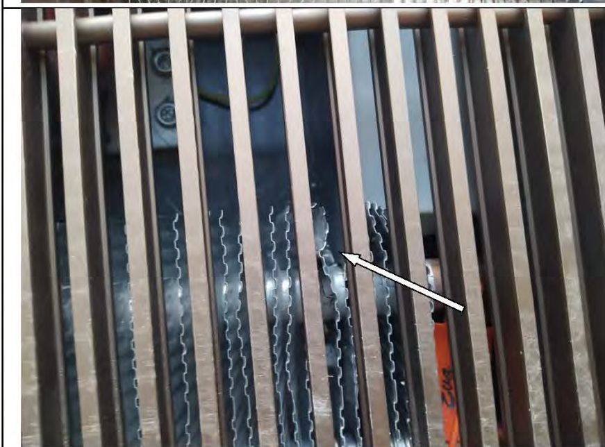
Фото №42. Радиатор в спальне имеет дефекты (замятия)
