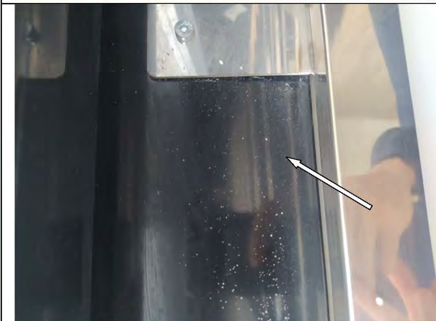
Фото №35. Профиль оконного блока в гостиной имеет дефекты (загрязнение малярными составами).
