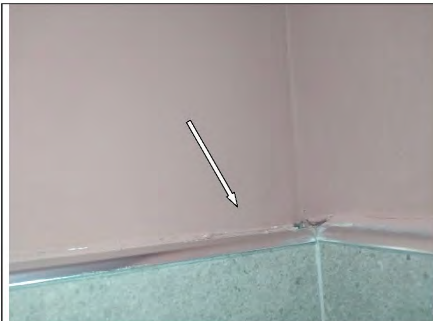
Фото №58. Окрашенные стены в санузле выполнены с дефектами (полосы, следы от инструмента)
