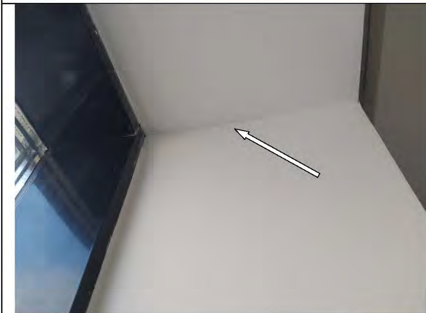
Фото №23. Окрашенные откосы оконного блока №3 в кухне выполнены с дефектами (трещины).
