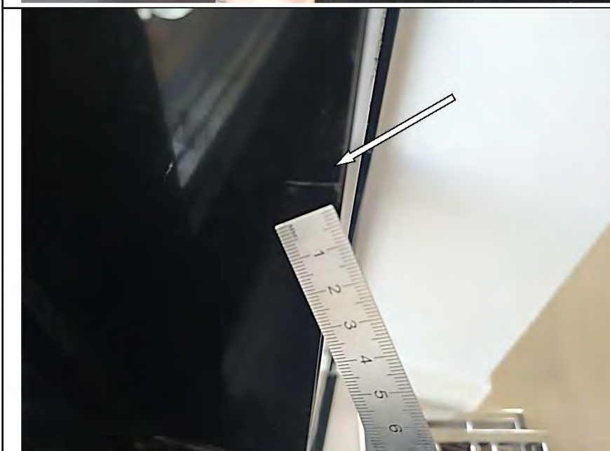
Фото №27. Профиль оконного блока №1 в кухне имеет дефекты (царапина).
