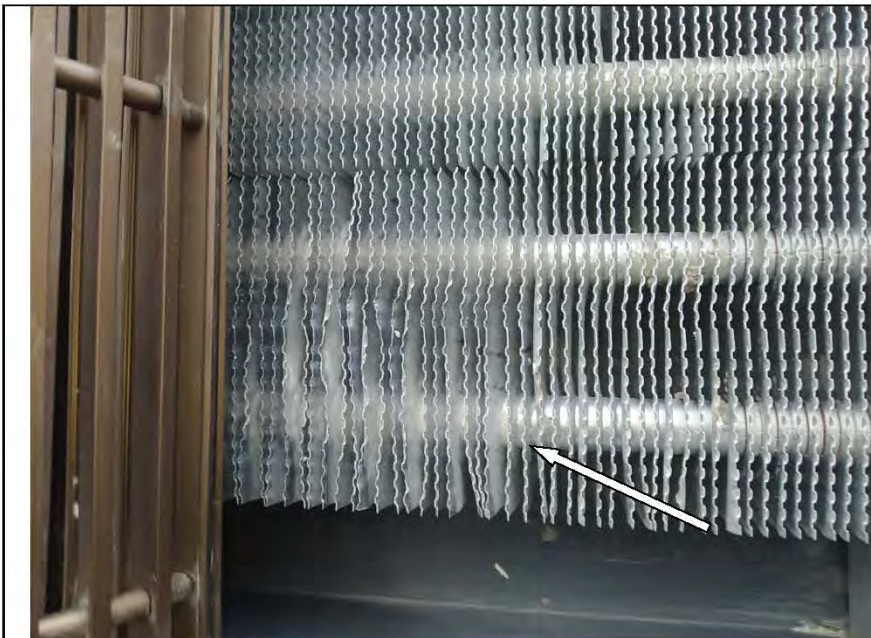
Фото №43. Радиатор в гостиной имеет дефекты (замятия)
