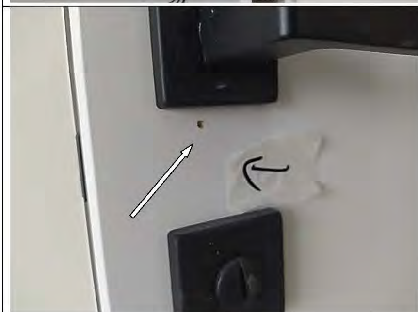
Фото №50. Дефекты (сколы) на лицевой поверхности полотна деревянного дверного блока в гостиной.
