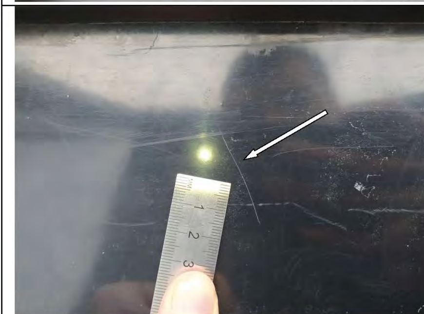
Фото №26. Профиль оконного блока №1 в кухне имеет дефекты (царапины).
