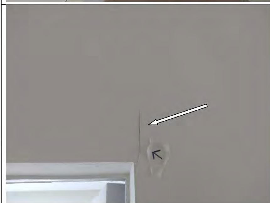
Фото №54. Разрыв обойного полотна в прихожей.
