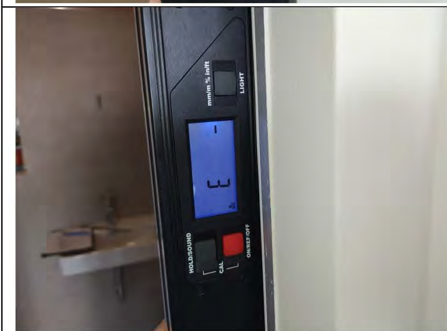
Фото №45. Отклонение коробки дверного блока в ванной комнате.
