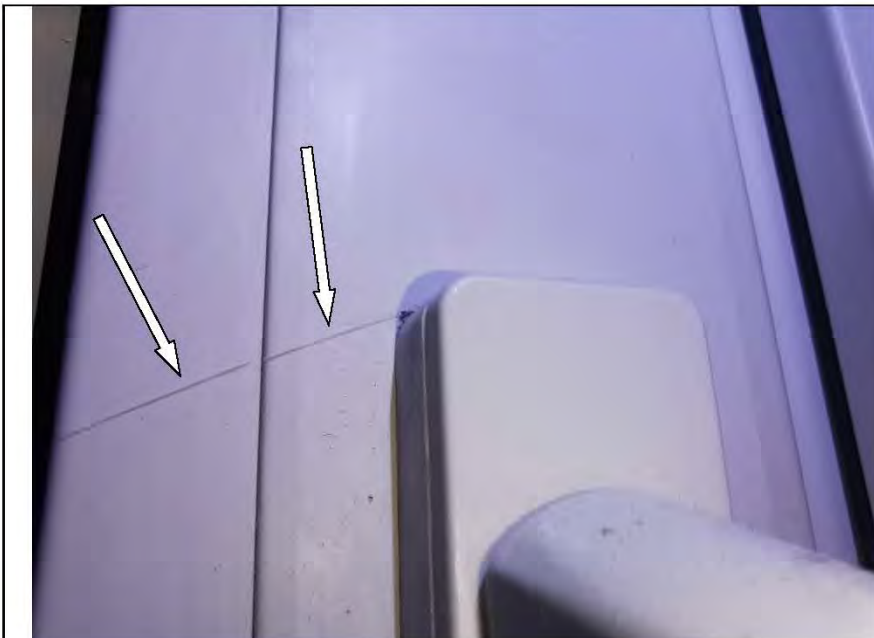
Фото №31. Царапины на профиле ПВХ оконного блока в комнате.
