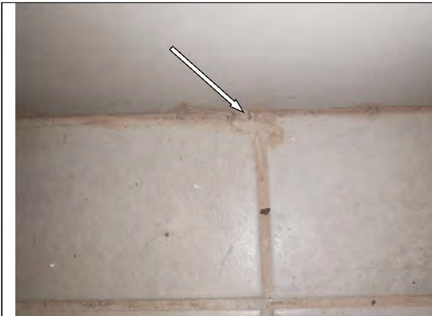
Фото №25. Некачественно выполнена затирка напольной керамической плитки в санузле.
