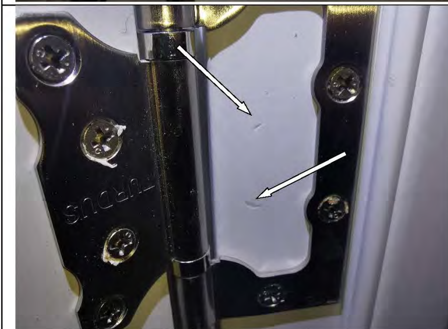
Фото №51. Повреждение короба деревянного дверного блока в комнате.
