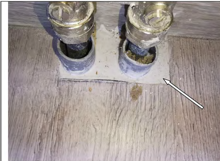
Фото №19. Заделка отверстия для трубопровода отопления в напольном покрытии из ламината в комнате выполнена с дефектом
