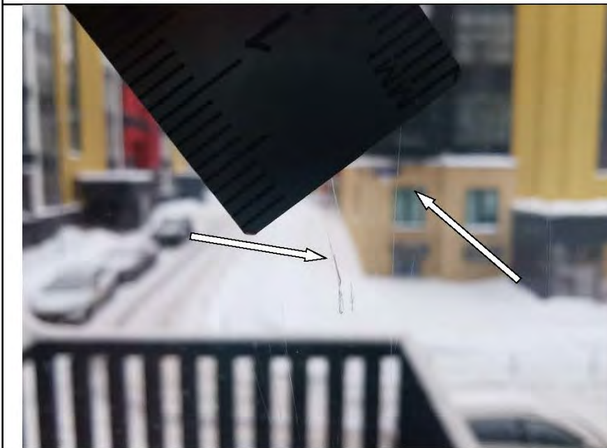
Фото №38. Царапины на стеклопакете оконного блока ПВХ в комнате.
