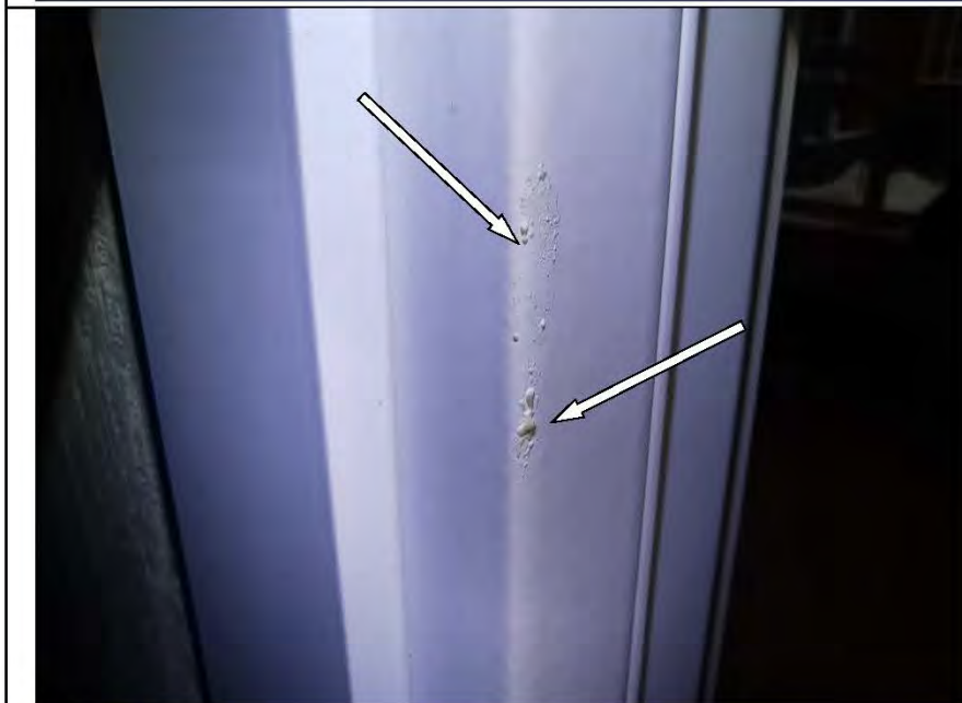
Фото №53. Загрязнение короба деревянного дверного блока в комнате.
