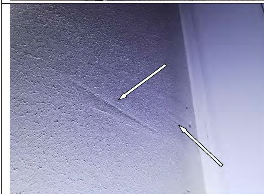
Фото №44. Окрашенные откосы оконного блока ПВХ выполнены с дефектами.
