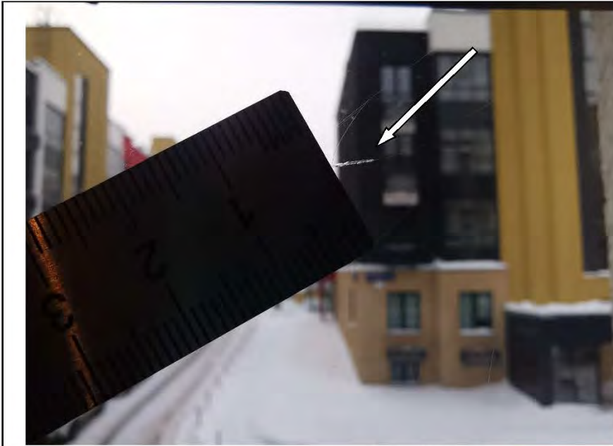
Фото №37. Царапины на стеклопакете оконного блока ПВХ в комнате.
