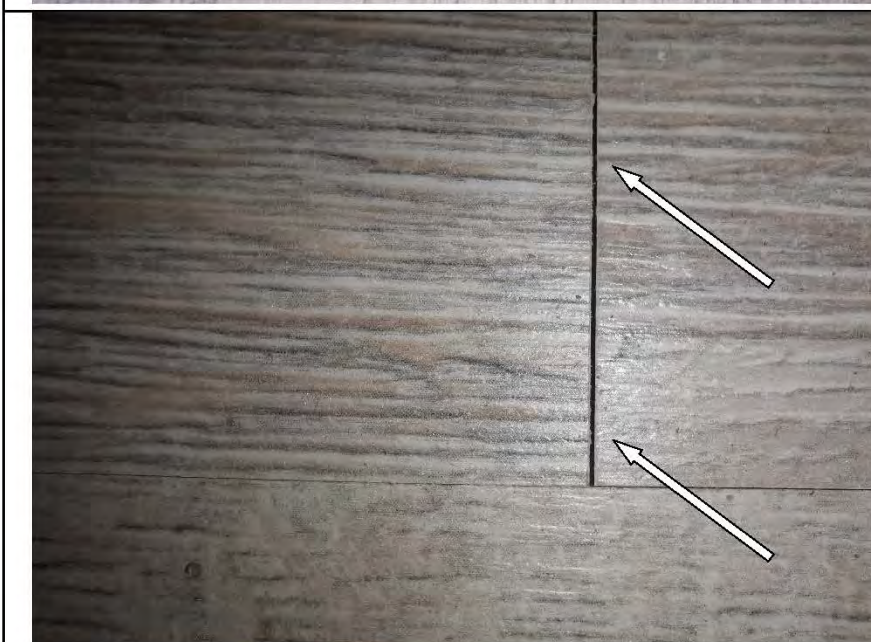
Фото №20. Зазор между соседними досками ламината в комнате.
