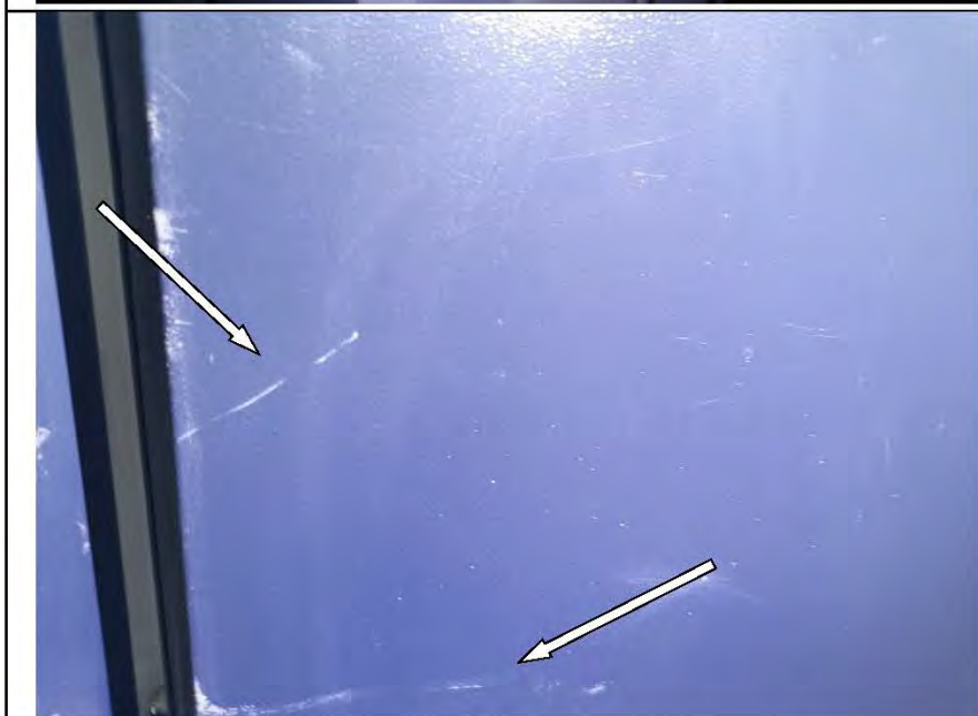
Фото №54. Царапины и загрязнения на полотне входного дверного блока.
