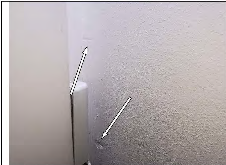
Фото №43. Окрашенные откосы оконного блока ПВХ в комнате выполнены с дефектами.
