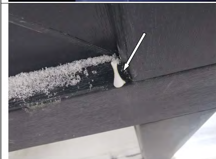
Фото №36. Потертости на профиле ПВХ оконного блока в комнате.
