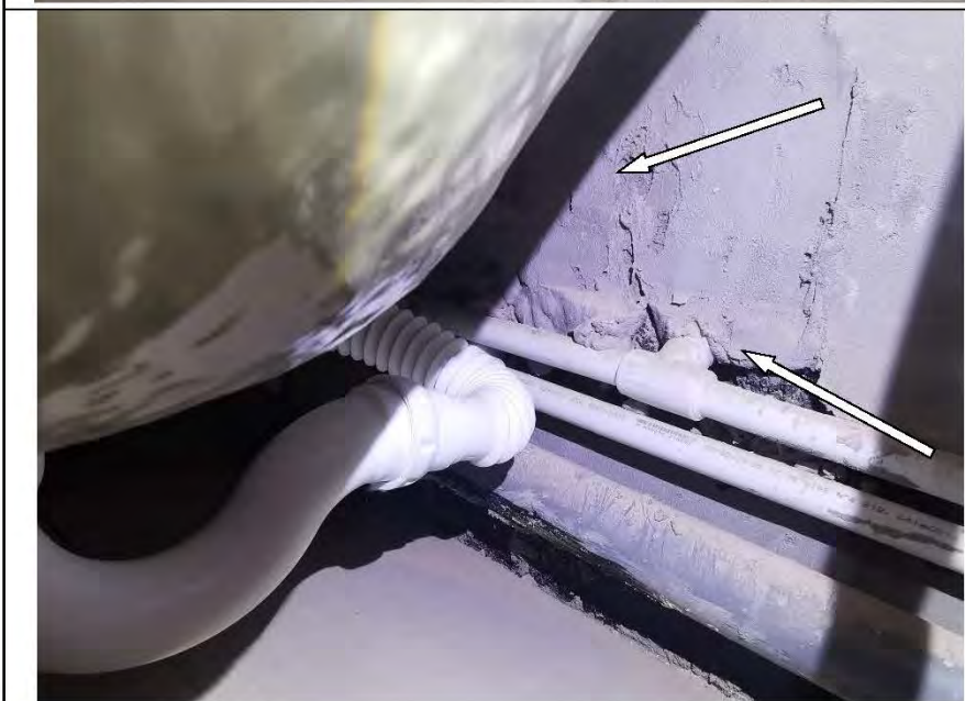
Фото №26. Частично отсутствует настенная керамическая плитка за ванной.
