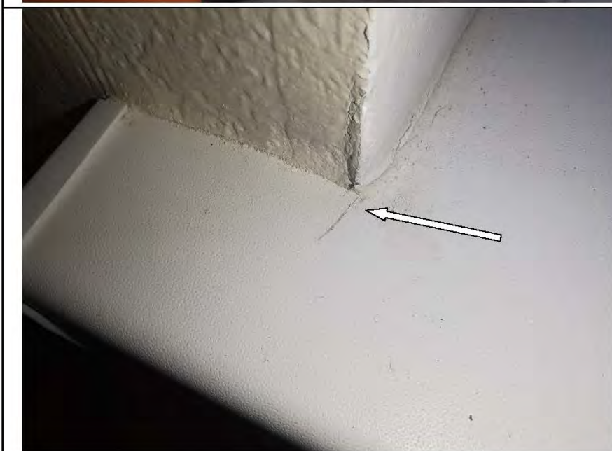
Фото №41. Царапины на лицевой поверхности подоконной доски в комнате.
