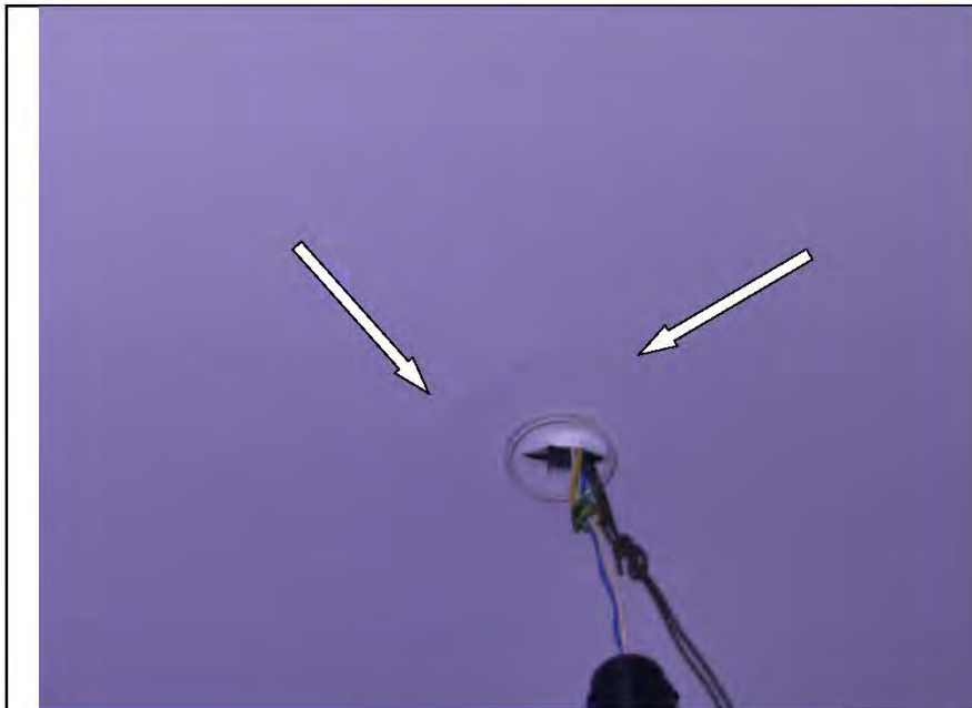
Фото №28. Видимость инженерных сетей на полотне натяжного потолка в санузле.
