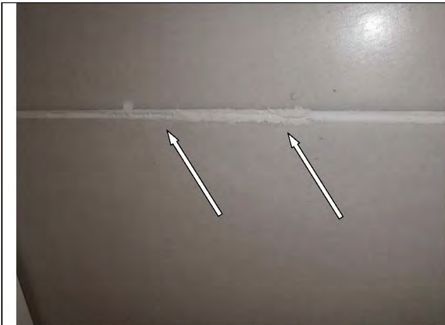
Фото №16. Некачественно выполнена затирка настенной керамической плитки в санузле.
