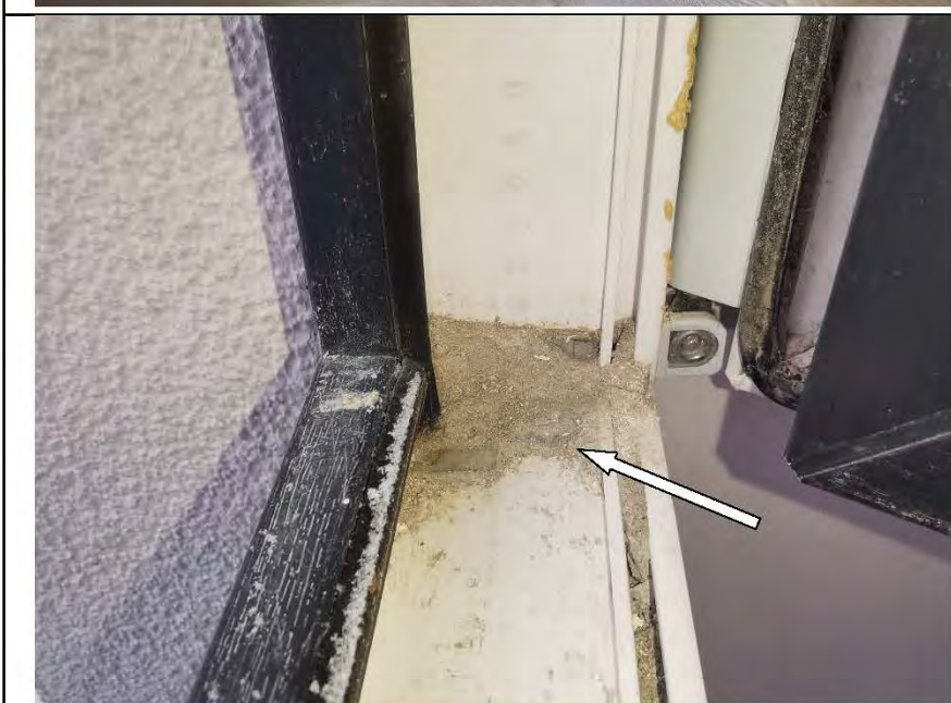
Фото №33. Загрязнения на профиле ПВХ оконного блока в комнате.
