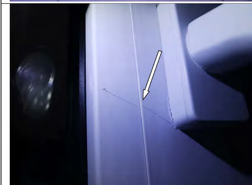
Фото №35. Царапины на профиле ПВХ оконного блока в комнате.
