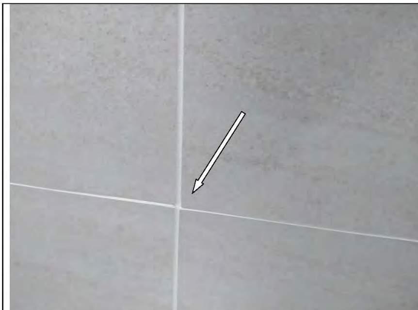
Фото №46. Затирка настенной плитки в санузле выполнена с нарушениями (разность ширины шва)
