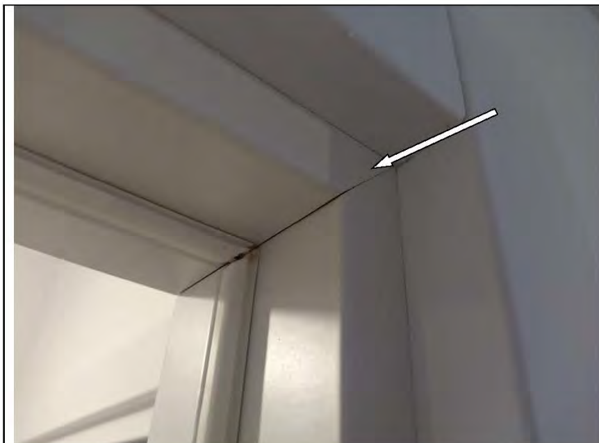
Фото №43. Элементы дверного блока соединены (коробка) не надежно в гостиной
