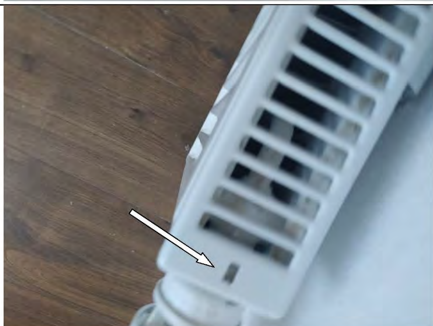
Фото №60. Отопительный прибор имеет дефект покраски защитного кожуха в гостиной (скол)
