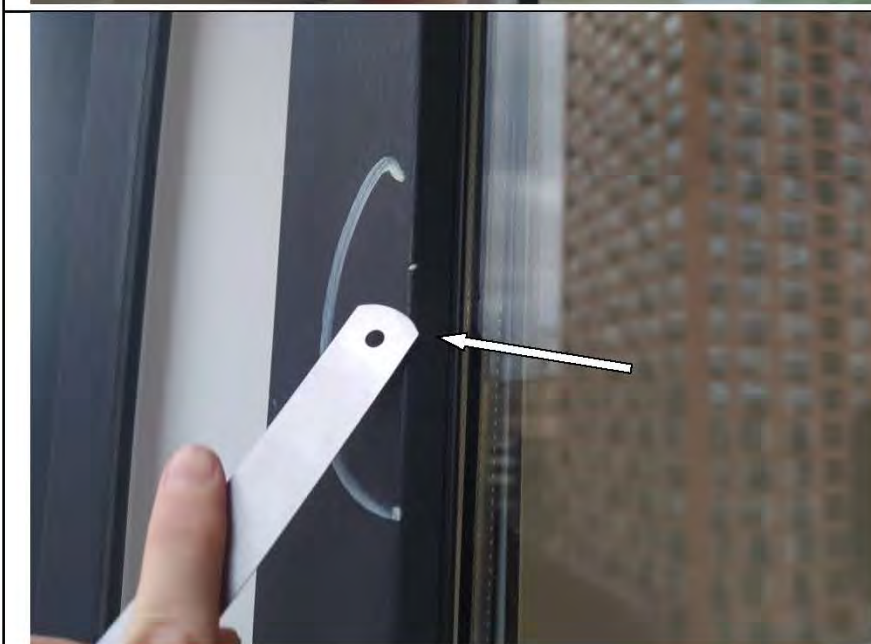
Фото №30. Профиль ПВХ дверного блока в гостиной имеет дефекты (скол).
