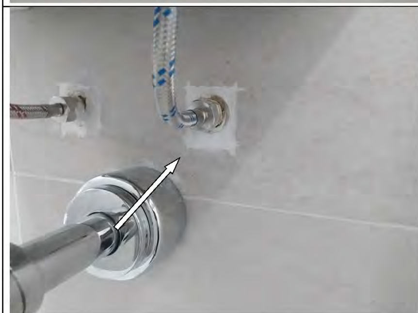
Фото №63. Дефект монтажа отверстий для прохода элементов водоснабжения в санузле.
