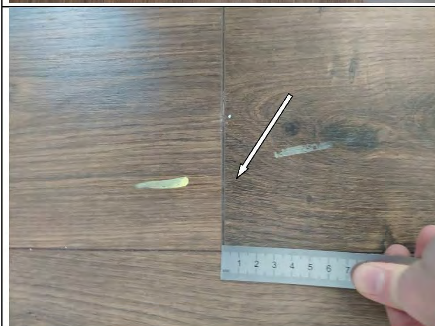
Фото №50. Зазор между соседними досками ламината в кухне.
