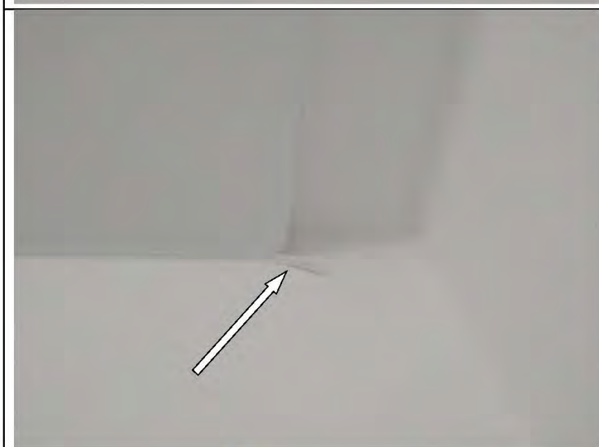
Фото №62. Дефект монтажа декоративного молдинга натяжного потолка в кухне
