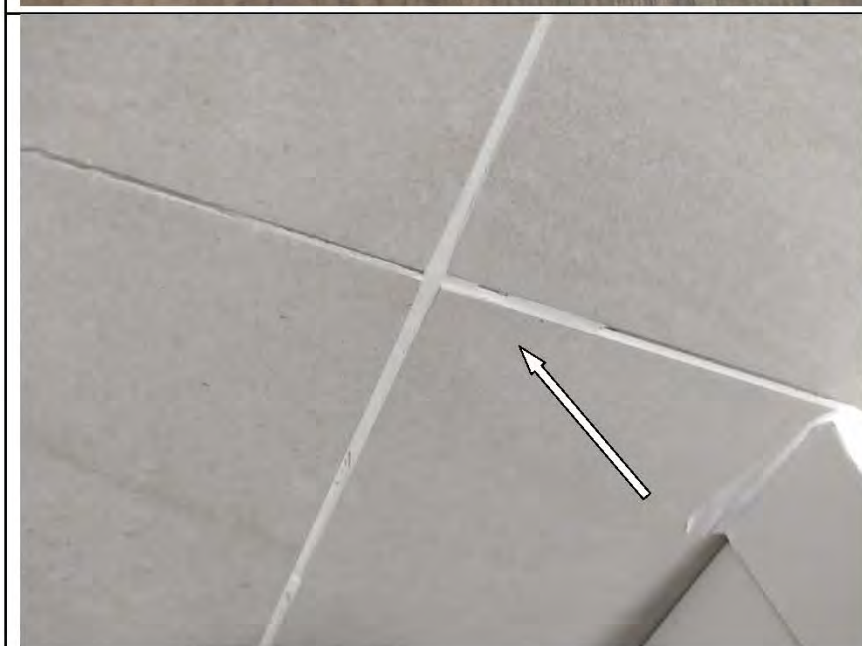
Фото №45. Затирка настенной плитки в ванной комнате выполнена с нарушениями (разность ширины шва, каверны)
