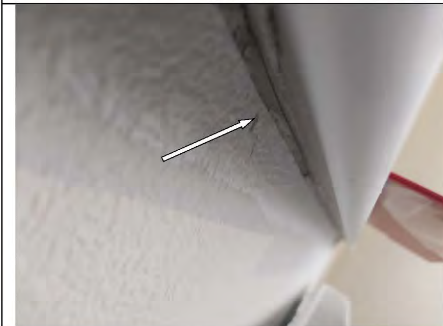
Фото №38. Отверстие под подоконником в гостиной не загерметизировано
