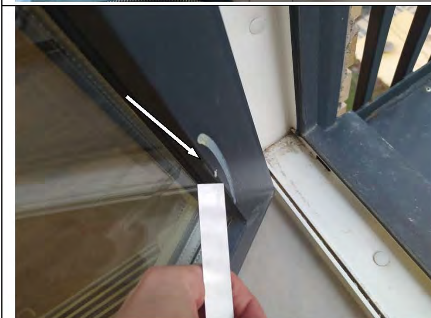
Фото №35. Профиль ПВХ дверного блока в кухне имеет дефекты (скол).
