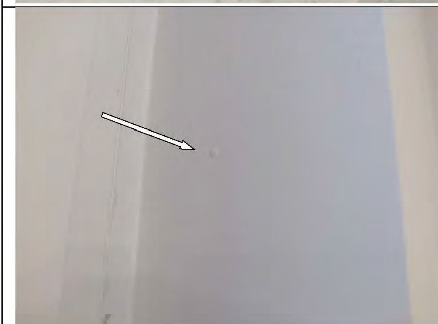
Фото №21. Окрашенные откосы дверного блока в кухне выполнены с дефектами (подтеки)
