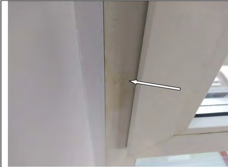
Фото №28. Профиль ПВХ оконного блока в гостиной имеет дефекты (загрязнение строительными составами).
