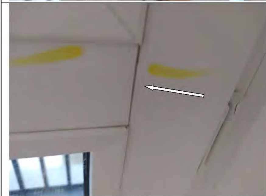
Фото №27. Профиль ПВХ дверного блока в спальне имеет дефекты (зазор).
