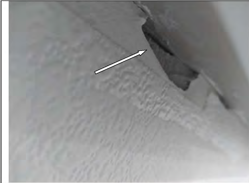
Фото №37. Отверстие под подоконником в кухне не загерметизировано
