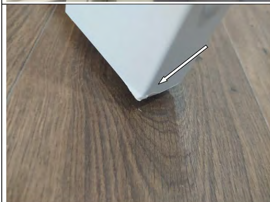
Фото №44. Дефекты (отслоение ламинции) на лицевой поверхности полотна деревянного дверного блока в ванной комнате
