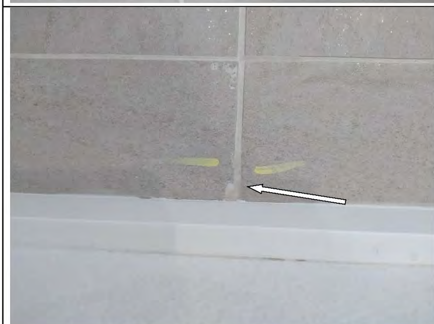
Фото №47. Затирка напольной плитки выполнена с нарушениями в кухне: разность ширины шва.
