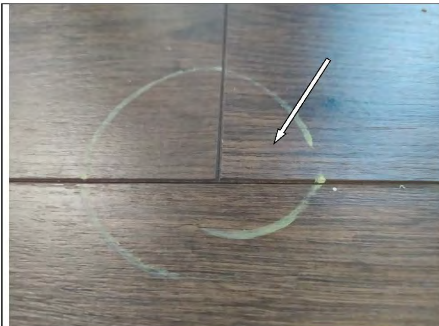
Фото №52. Поднятые кромки досок ламината в спальне
