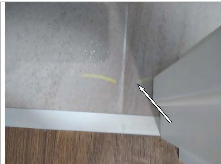
Фото №49. Затирка напольной плитки выполнена с нарушениями в ванной комнате: разность ширины шва.
