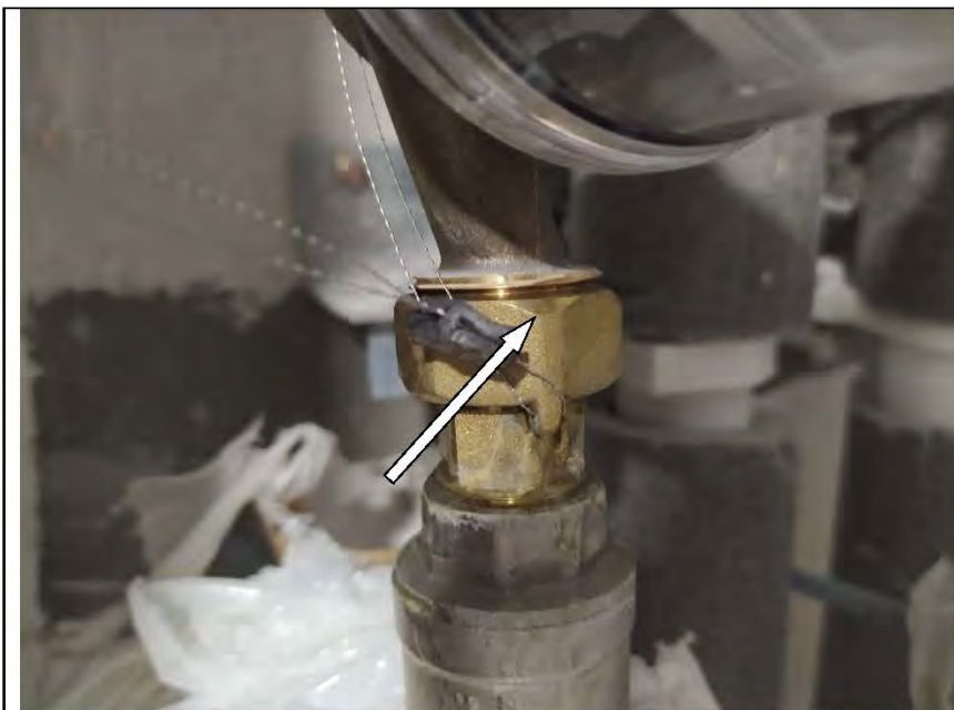
Фото №64. Течь в месте соединения счетчика ГВС и труб водоснабжения.
