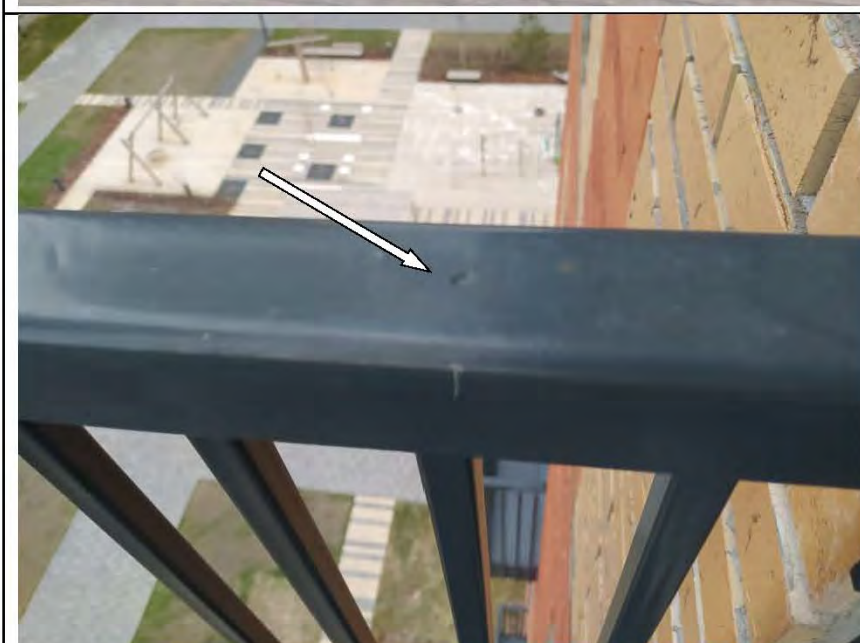
Фото №54. Дефект металлического профиля ограждения летнего помещения №1 в спальне (скол).
