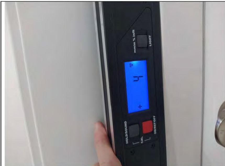
Фото №58 Отклонение коробки входного дверного блока
