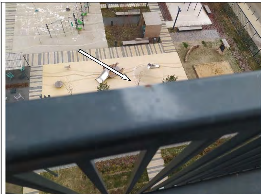
Фото №55. Дефект металлического профиля ограждения летнего помещения №2 в гостиной (скол, коррозия).
