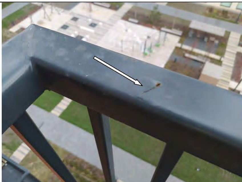
Фото №56. Дефект металлического профиля ограждения летнего помещения №3 в кухне (скол, коррозия).
