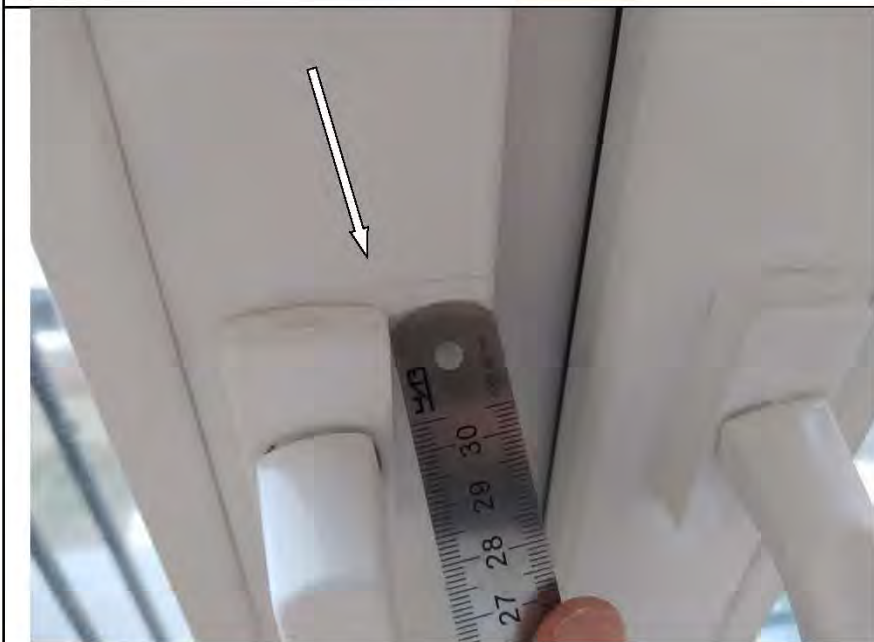
Фото №26. Профиль ПВХ дверного блока в спальне имеет дефекты (царапина).
