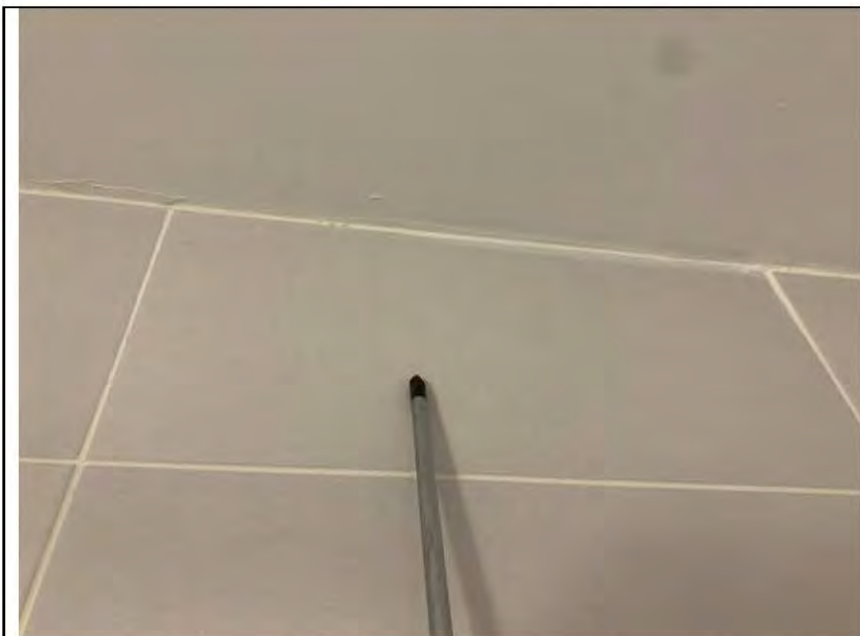
Фото №53. Пустоты при простукивании настенной плитки в санузле
