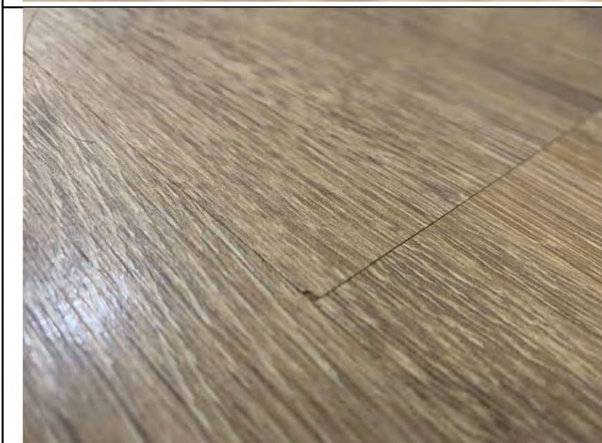
Фото №28. Скол на лицевой поверхности ламината на кухне
