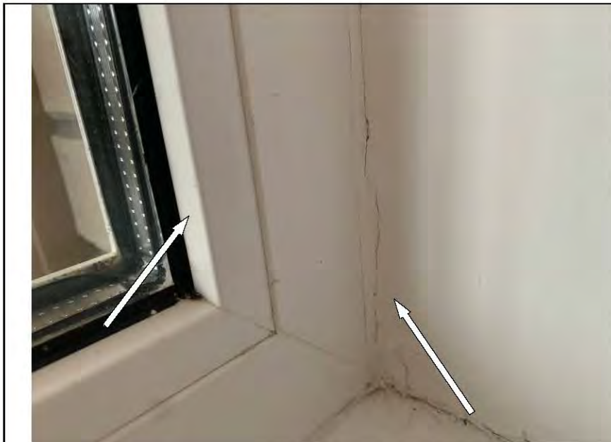
Фото №35. Трещины в зоне монтажного шва примыкания балконного блока к проёму на кухне
