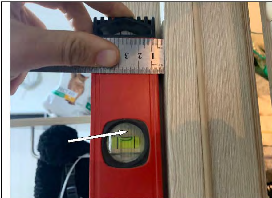
Фото №38. Отклонение дверного блока в комнате от вертикали
