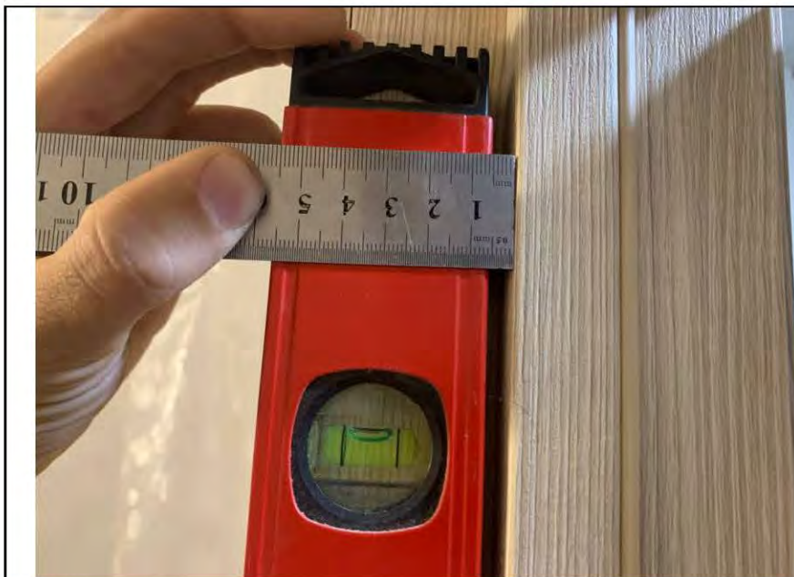
Фото №20. Отклонение смонтированного дверного блока санузла от вертикали
