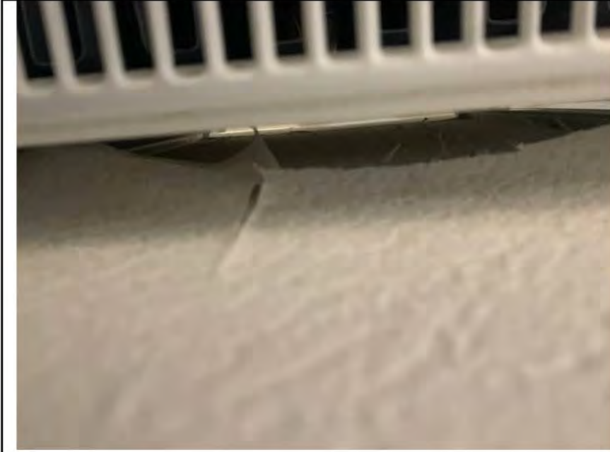
Фото №61. Обои за радиаторами не проклеены в помещении кухни
