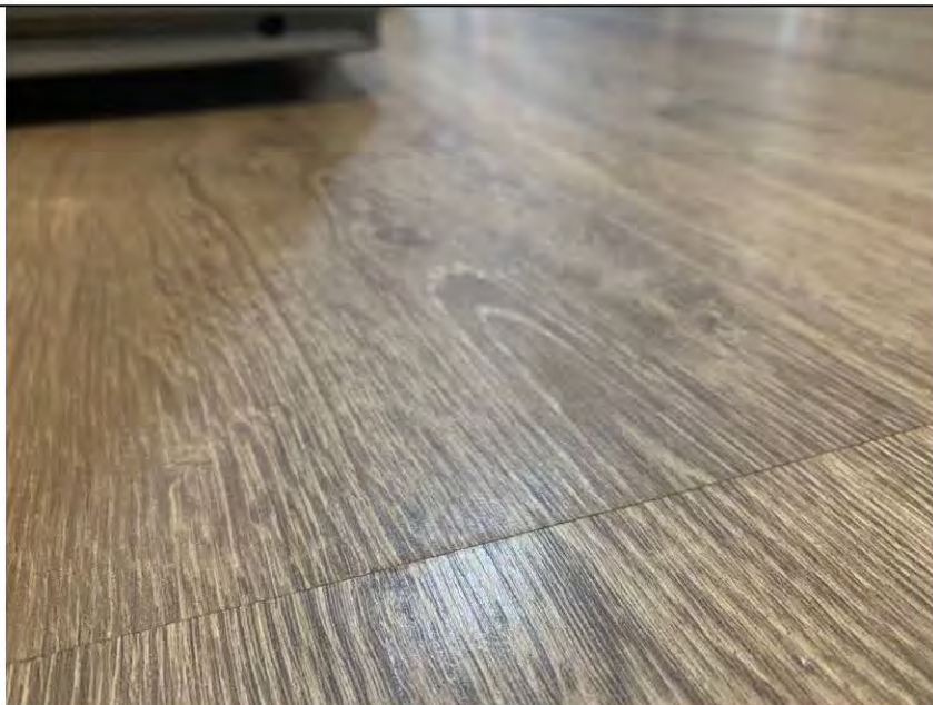
Фото №29. Приподнятость кромок ламината на кухне
