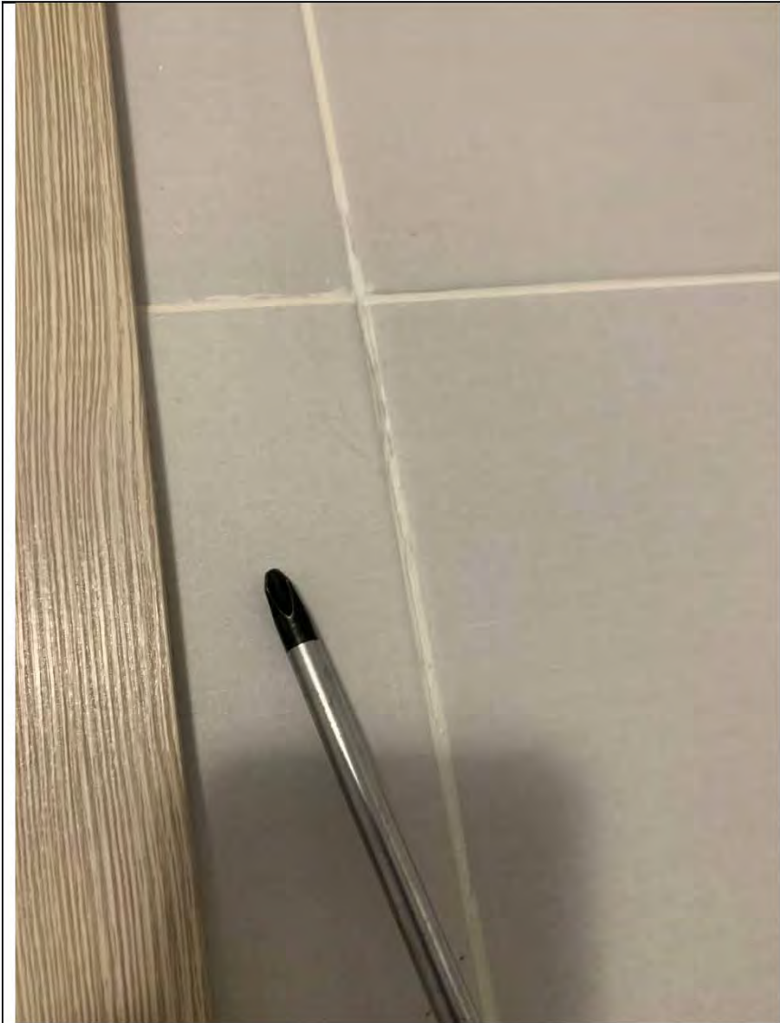
Фото №51. Пустоты при простукивании настенной плитки в санузле
