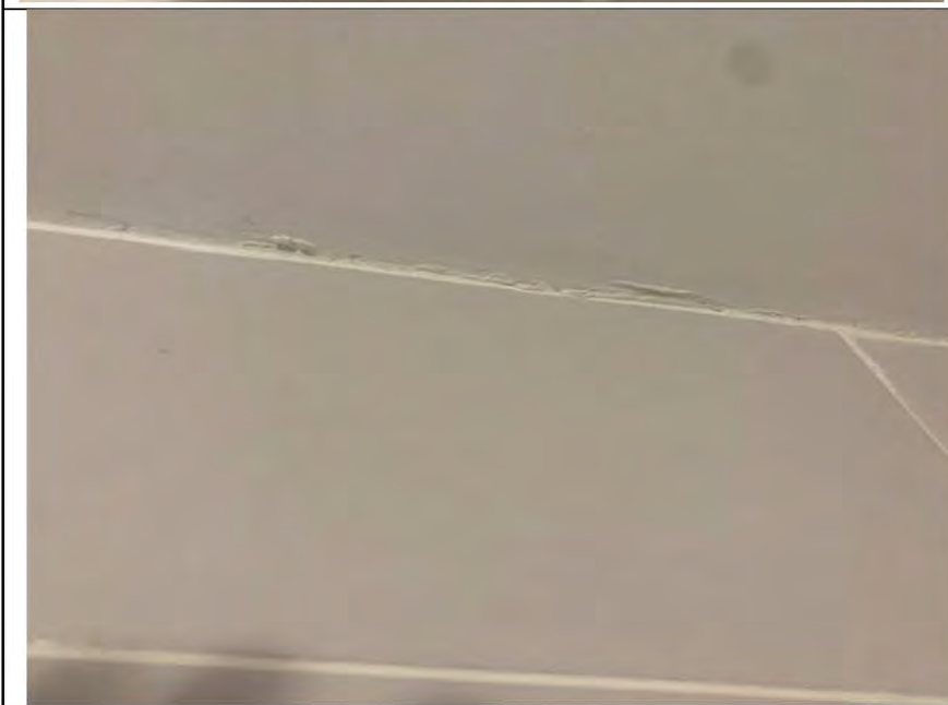
Фото №56. Наплывы краски или строительных растворов на потолке в санузле
