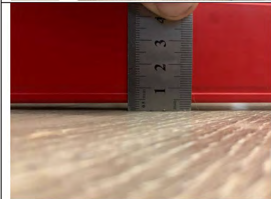
Фото №27. Отклонение уровня пола на кухне
