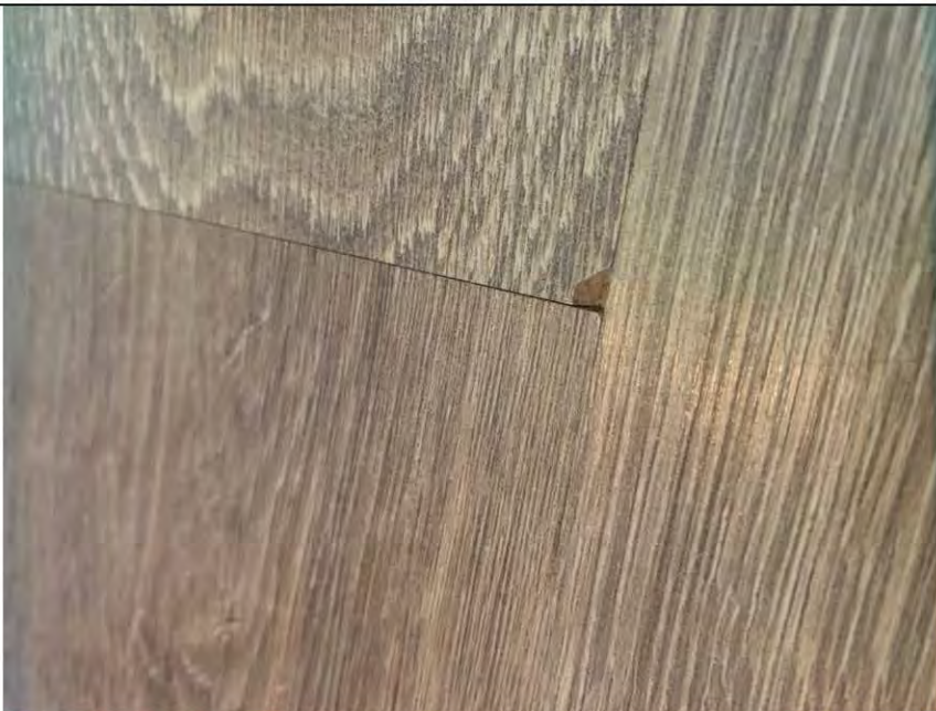
Фото №49. Сколы на лицевой поверхности покрытия ламината в комнате
