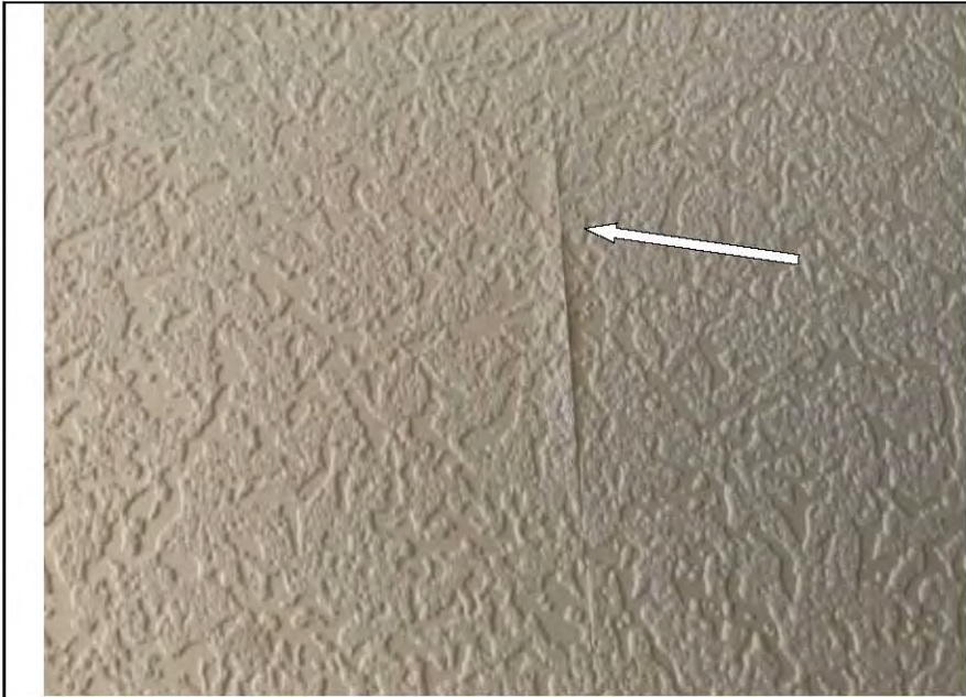
Фото №41. Читаемые обойные стыки, отслоение обойного полотна в комнате.
