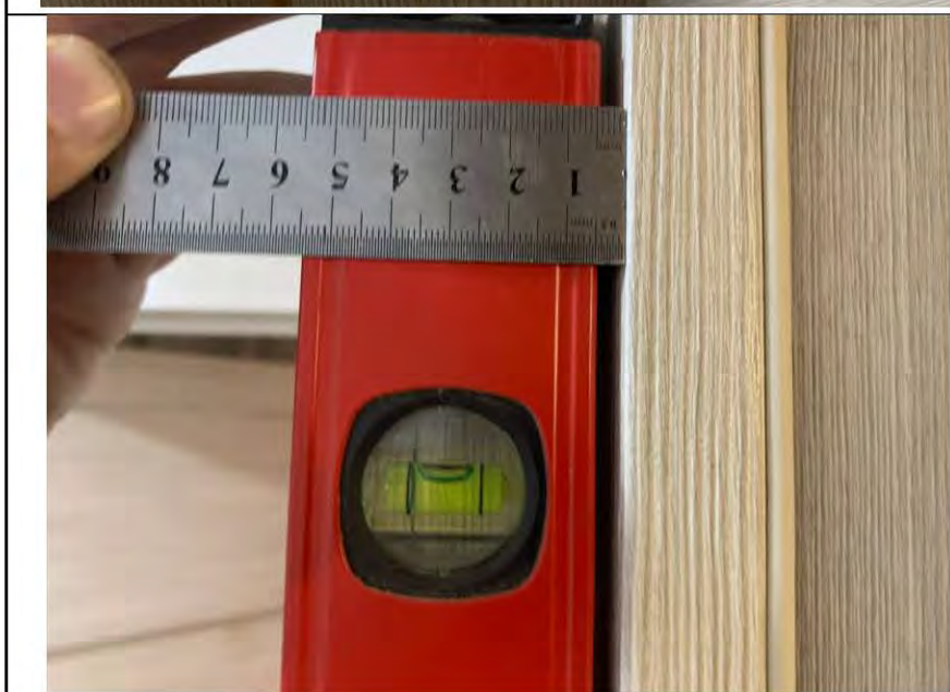
Фото №22. Отклонение смонтированного дверного блока кухни от вертикали
