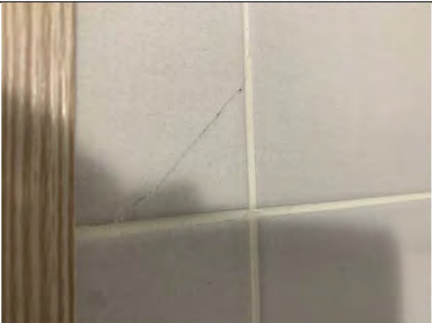
Фото №50. Трещина на облицовке из керамической плитки на стене в санузле
