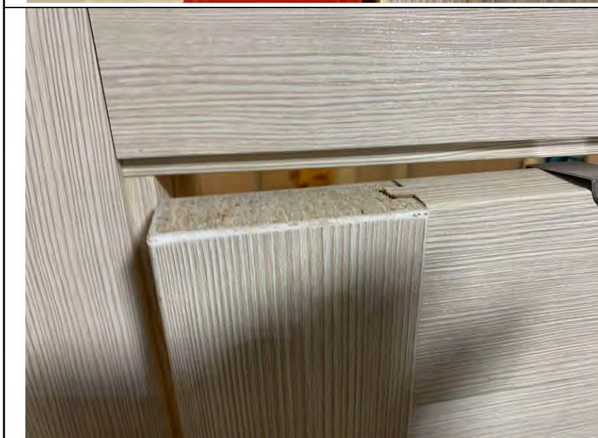
Фото №21. Вмятины полотна дверной коробки на кухне.
