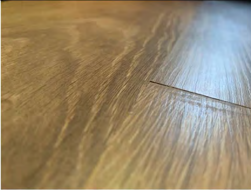
Фото №48. Приподнятость кромок покрытия ламината в комнате
