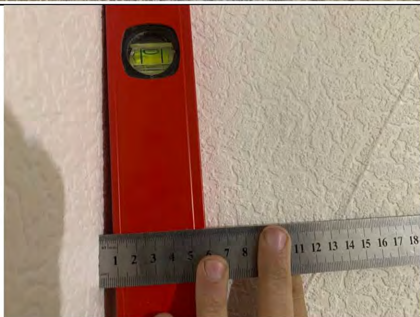
Фото №30. Отклонение от вертикали на стене кухни
