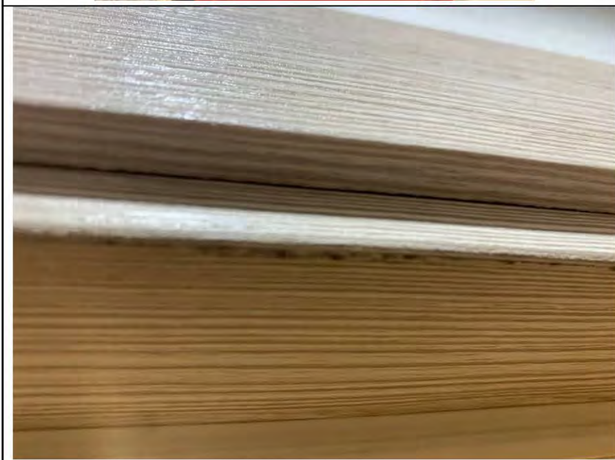
Фото №19. Отслоение ламинированного слоя дверной коробки в санузле
