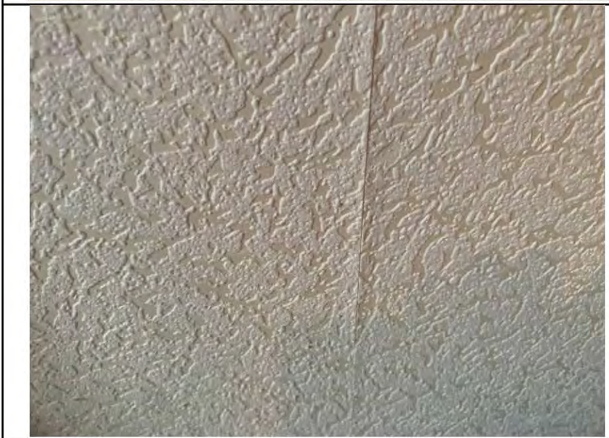
Фото №42. Читаемые обойные стыки, отслоение обойного полотна в комнате.
