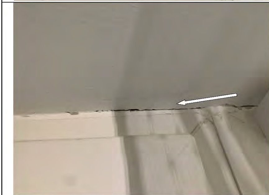
Фото №36. Трещины в зоне монтажного шва примыкания балконного блока к проёму на кухне
