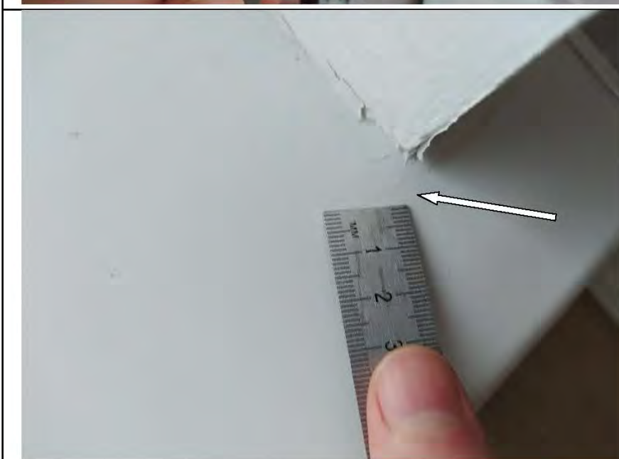
Фото №39. На лицевой поверхности подоконной доски в кухне имеются дефекты (царапина).
