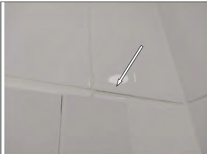
Фото №55. Затирка настенной плитки в санузле выполнена с нарушениями (каверны)
