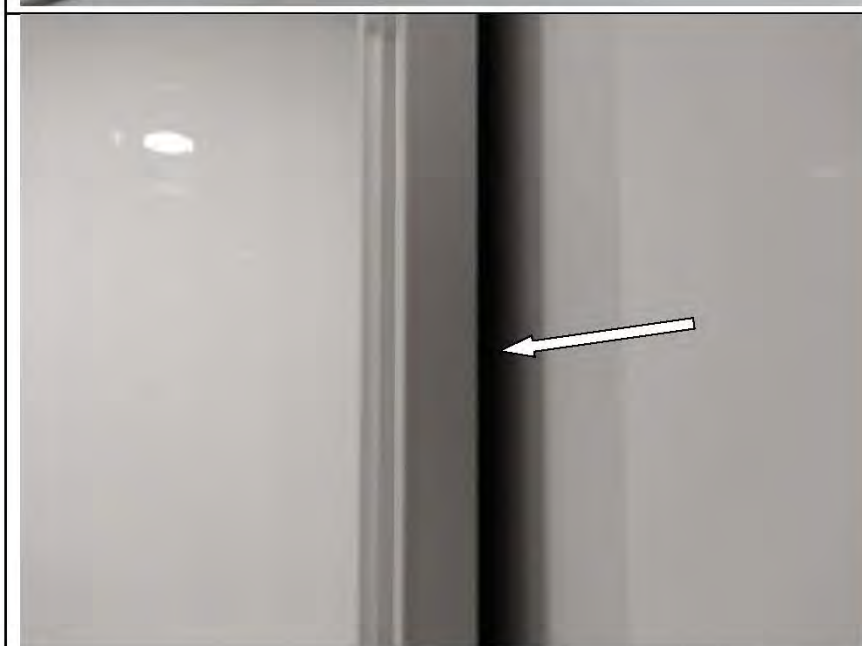
Фото №72. Неплотное прилегание дверного наличника к стене в ванной комнате
