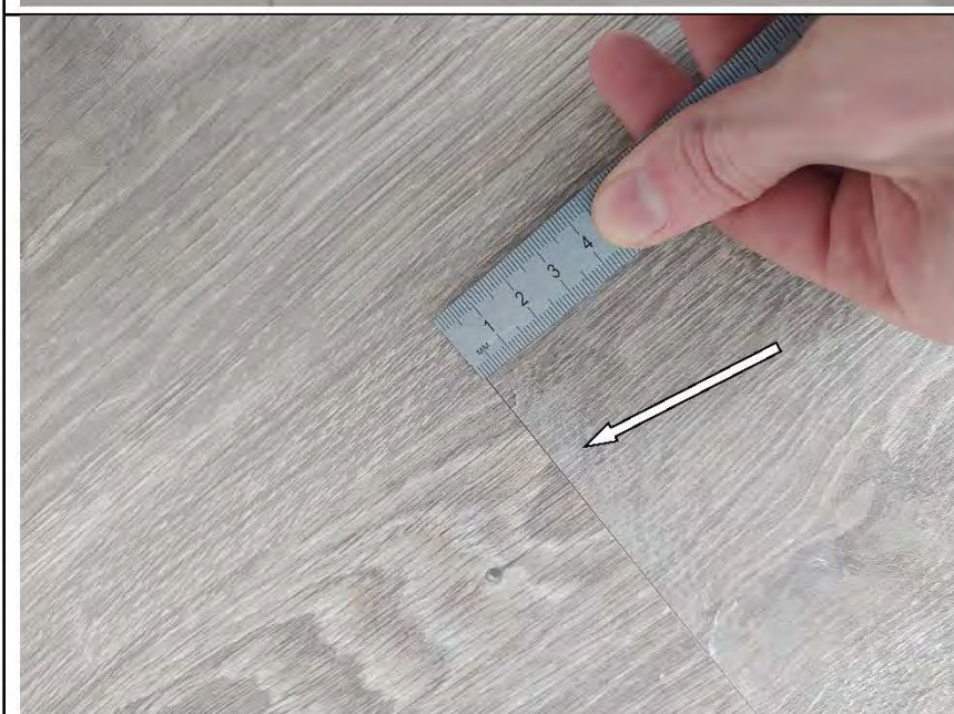
Фото №56. Зазор между соседними досками ламината в гостиной.
