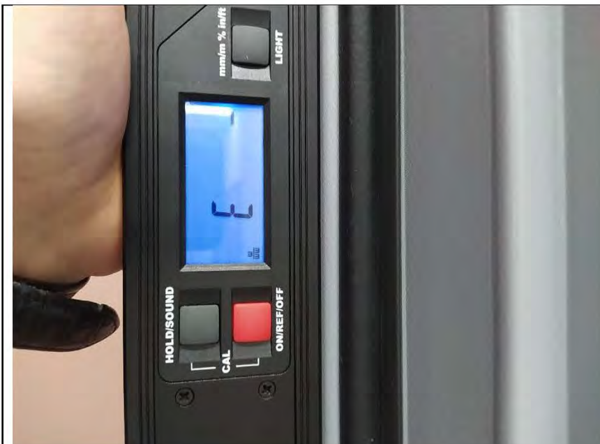
Фото №61 Отклонение коробки входного дверного блока
