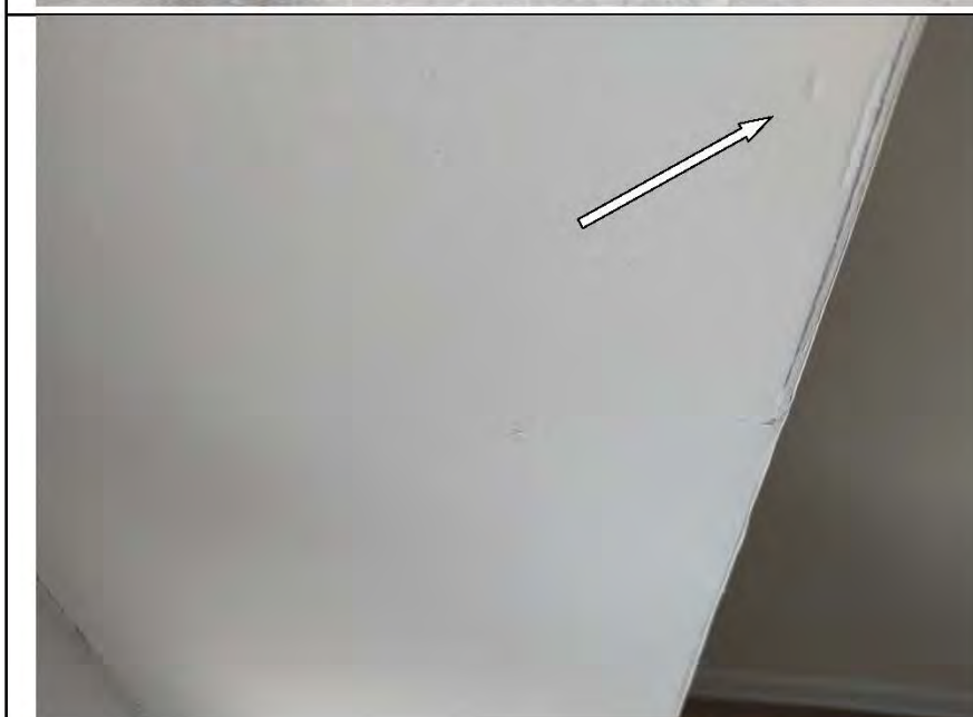
Фото №23. Окрашенные откосы оконного блока в кухне выполнены с дефектами (раковины)
