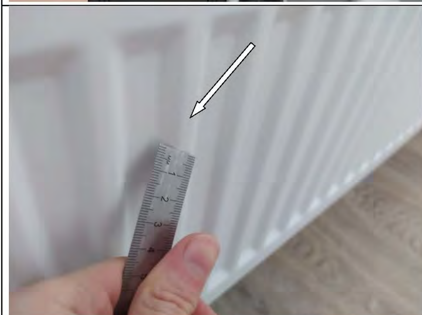
Фото №62. Отопительный прибор имеет дефект покраски защитного кожуха в кухне (царапина)
