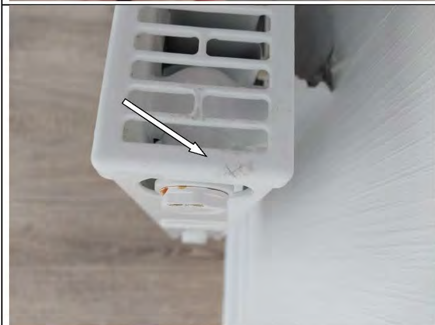
Фото №63. Отопительный прибор имеет дефект покраски защитного кожуха в кабинете (скол)
