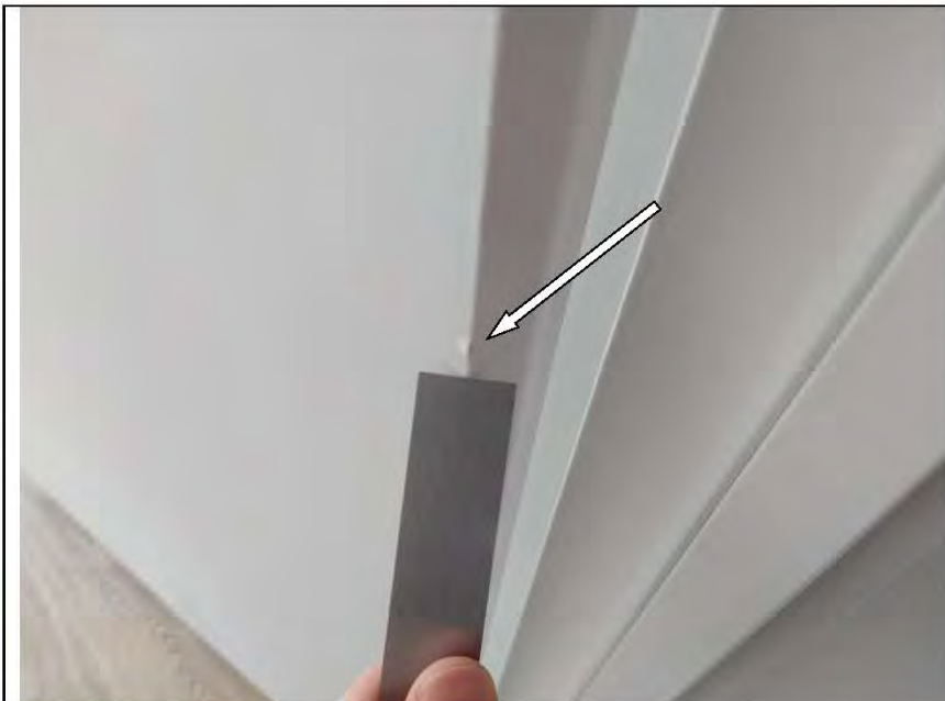
Фото №49. Дефекты (скол) на лицевой поверхности полотна деревянного дверного блока в кабинете
