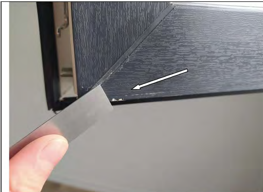
Фото №37. Профиль ПВХ оконного блока в кабинете имеет дефекты (скол).
