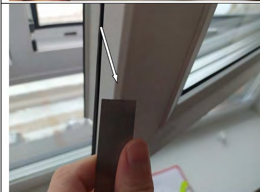
Фото №32. Профиль ПВХ оконного блока в кухне имеет дефекты (сколы).
