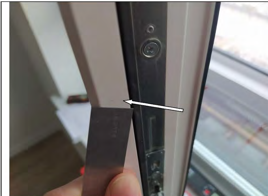
Фото №34. Профиль ПВХ оконного блока в спальне имеет дефекты (окалина).
