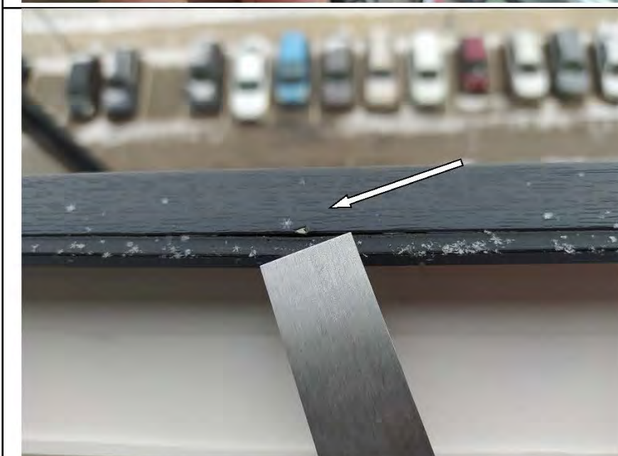
Фото №35. Профиль ПВХ оконного блока в гостиной имеет дефекты (скол).
