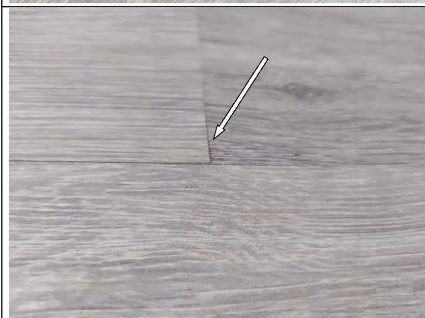
Фото №57. Поднятые кромки досок ламината в кухне
