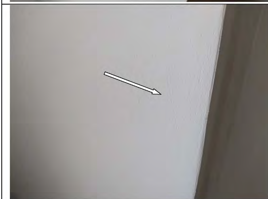
Фото №24. Окрашенные откосы оконного блока в спальне выполнены с дефектами (следы от инструмента)
