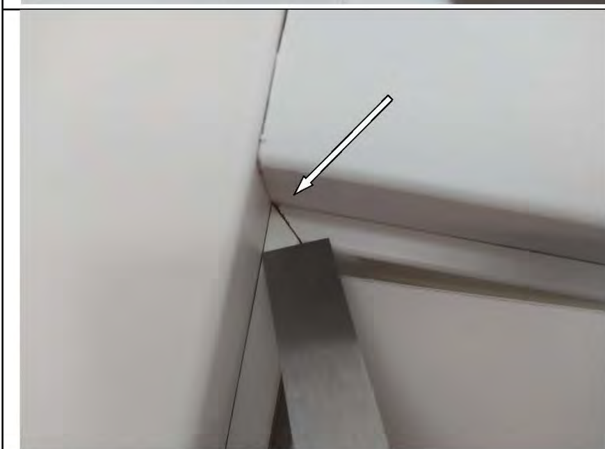
Фото №42. Коробка деревянного дверного блока в кабинете имеет дефекты (скол).
