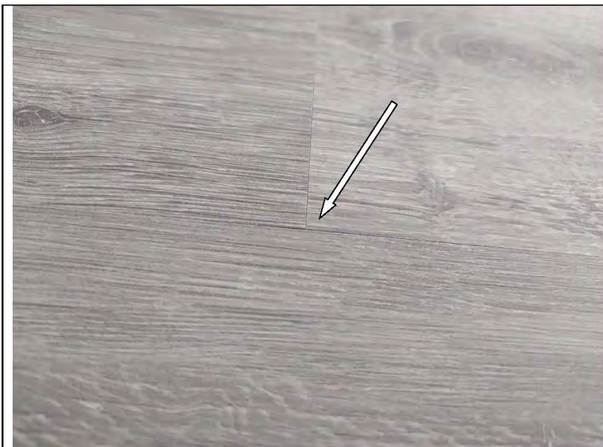
Фото №58. Поднятые кромки досок ламината в спальне
