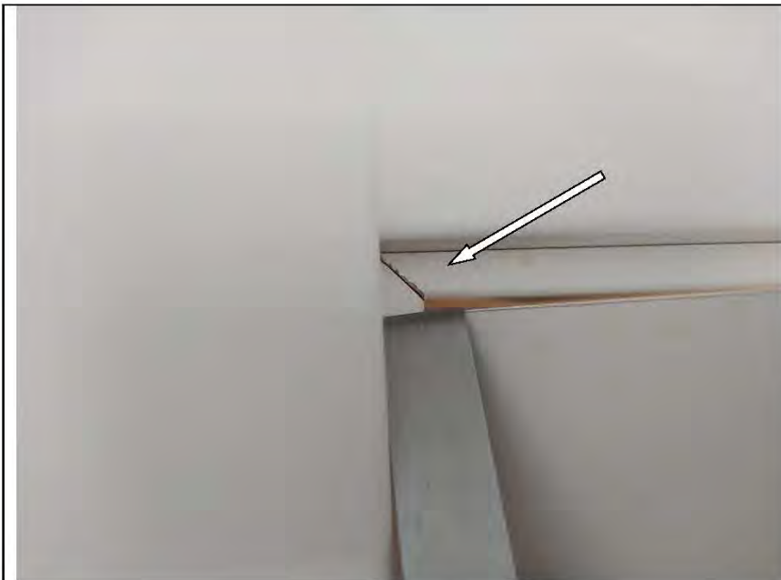
Фото №43. Коробка деревянного дверного блока в спальне имеет дефекты (сколы).
