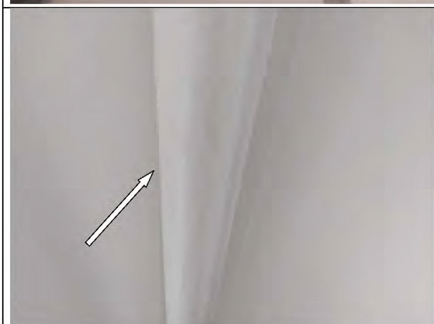
Фото №65. Окрашивание труб отопления выполнено с дефектами (подтеки) в кухне
