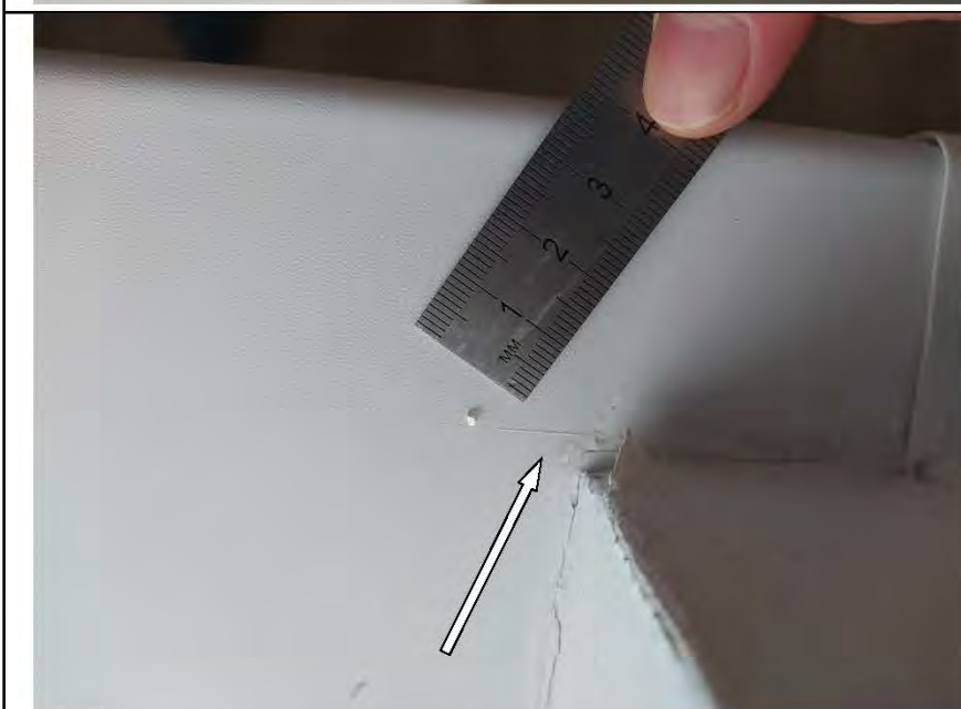
Фото №41. На лицевой поверхности подоконной доски в гостиной имеются дефекты (царапина).
