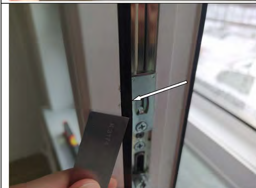
Фото №38. Профиль ПВХ оконного блока в кабинете имеет дефекты (сколы).
