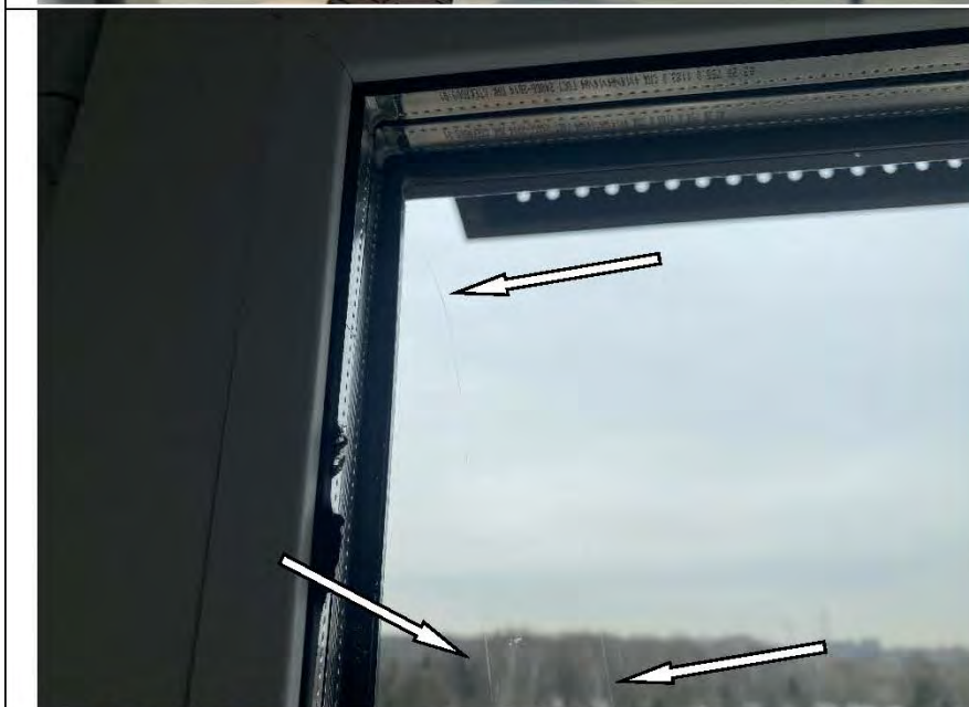
Фото №56. Царапины на стеклопакете оконного блока ПВХ в спальне.
