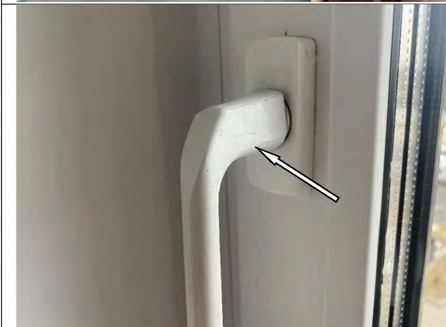
Фото №59. Царапины на фурнитуре оконного блока ПВХ в гостиной (ручке).
