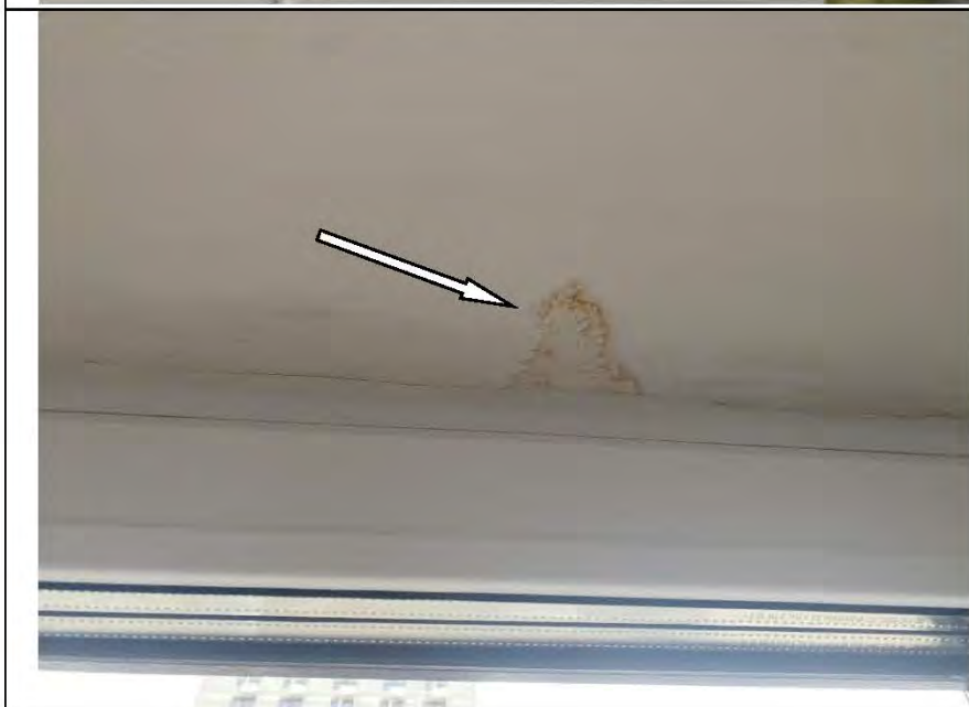
Фото №48. Откосы оконного блока ПВХ в кухне имеют следы заливия.
