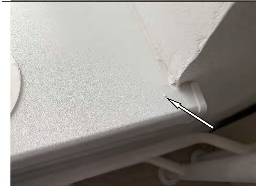
Фото №51. Загрязнения на поверхности подоконника в кухне.
