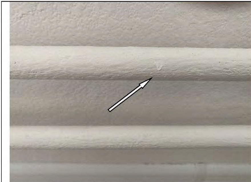
Фото №82. Окрашивание труб отопления выполнено с дефектами в спальне.
