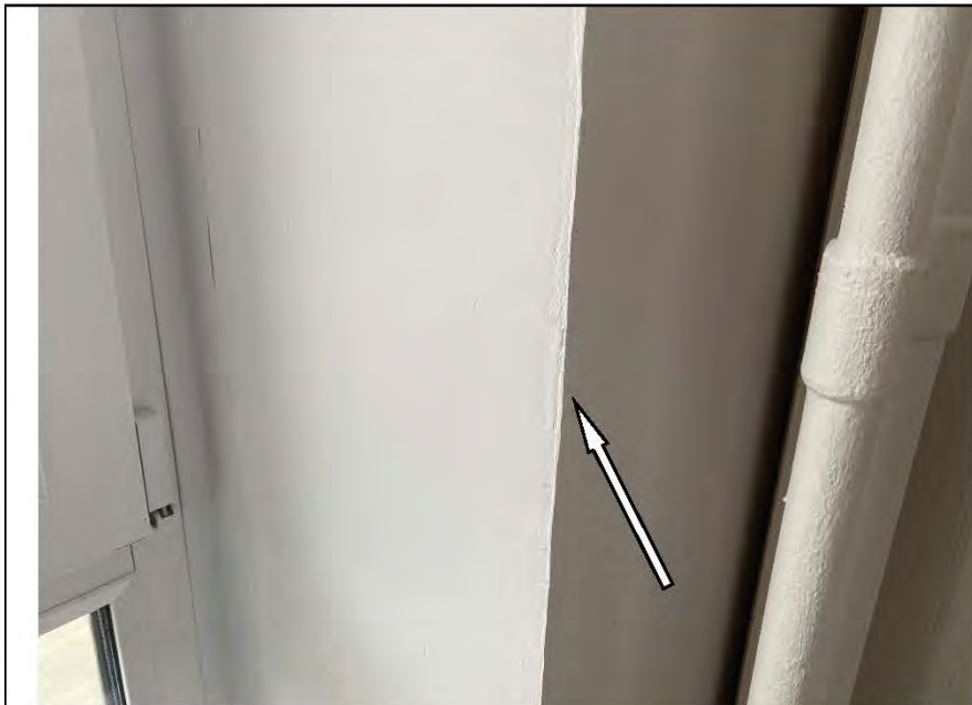
Фото №46. Окрашенные откосы оконного блока ПВХ выполнены с дефектами в кухне.
