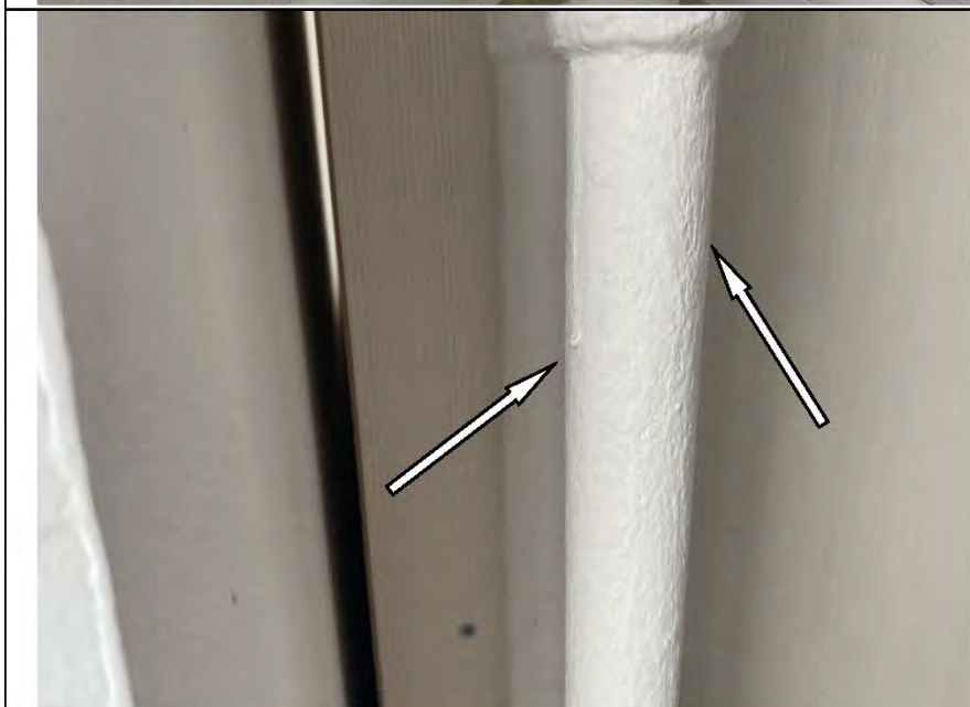
Фото №84. Окрашивание труб отопления выполнено с дефектами в кухне.
