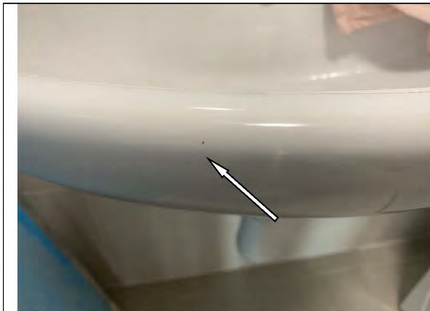
Фото №31. Повреждения на раковине в ванной комнате.
