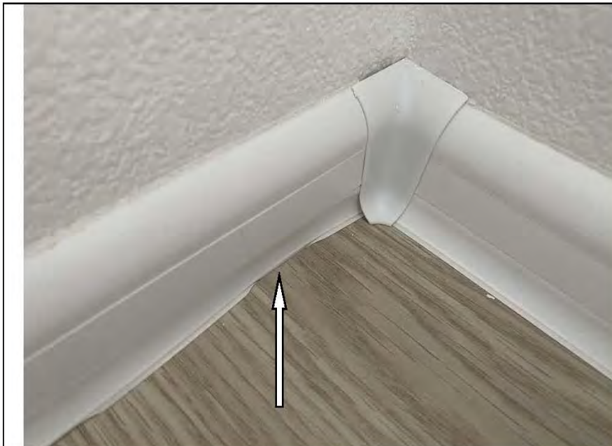
Фото №85. Напольный плинтус ПВХ неплотно прилегает к напольному покрытию в гостиной.
