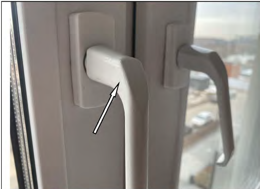
Фото №61. Повреждения на фурнитуре оконного блока ПВХ в спальне (ручке).
