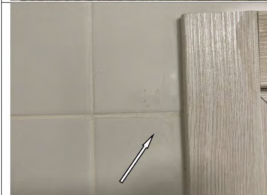
Фото №86. На настенной керамической плитке в ванной комнате имеются дефекты (загрязнения).
