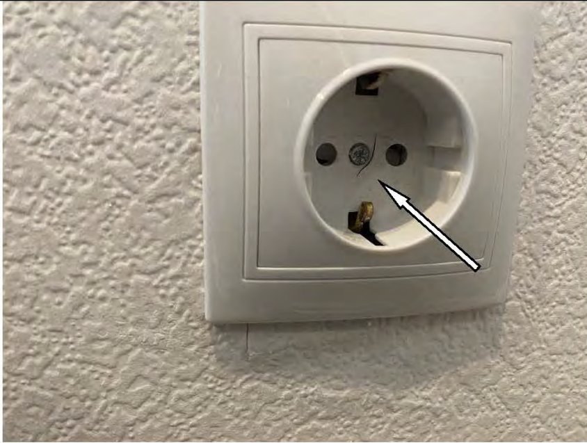
Фото №22. Штепсельная розетка установлена с дефектом в коридоре.
