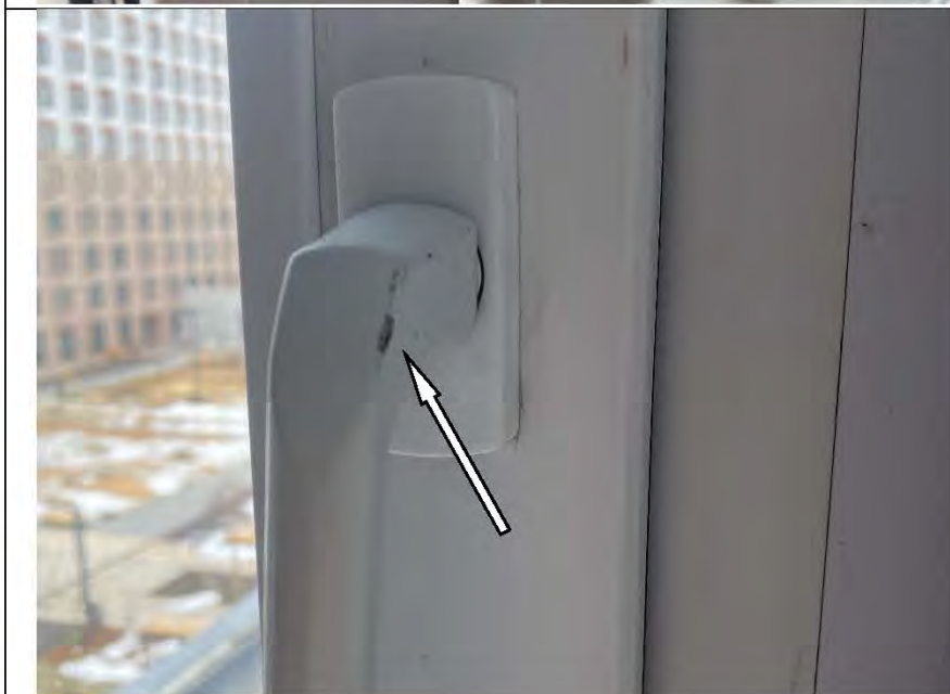
Фото №62. Повреждения на фурнитуре оконного блока ПВХ в кухне (ручке).
