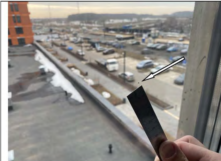
Фото №58. На стеклопакете оконного блока ПВХ в кухне имеется дефект (окалина).
