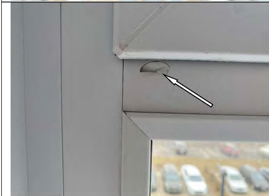
Фото 75. Повреждение профиля ПВХ оконного блока в гостиной.
