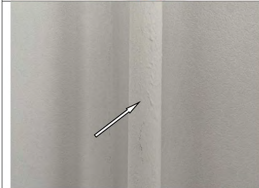
Фото №80. Окрашивание труб отопления выполнено с дефектами в гостиной.
