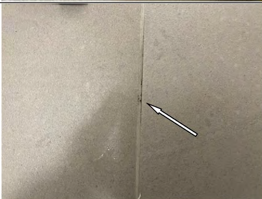
Фото №24. Затирка напольной плитки выполнена с нарушениями в санузле: неполное заполнение шовного пространства затирочным составом.
