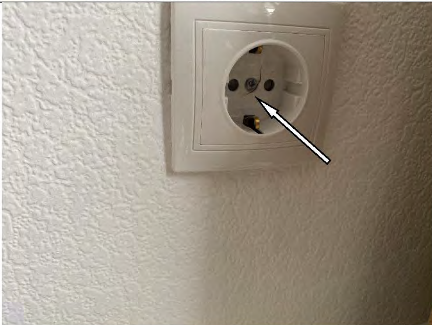
Фото №23. Штепсельная розетка установлена с дефектом в гостиной.
