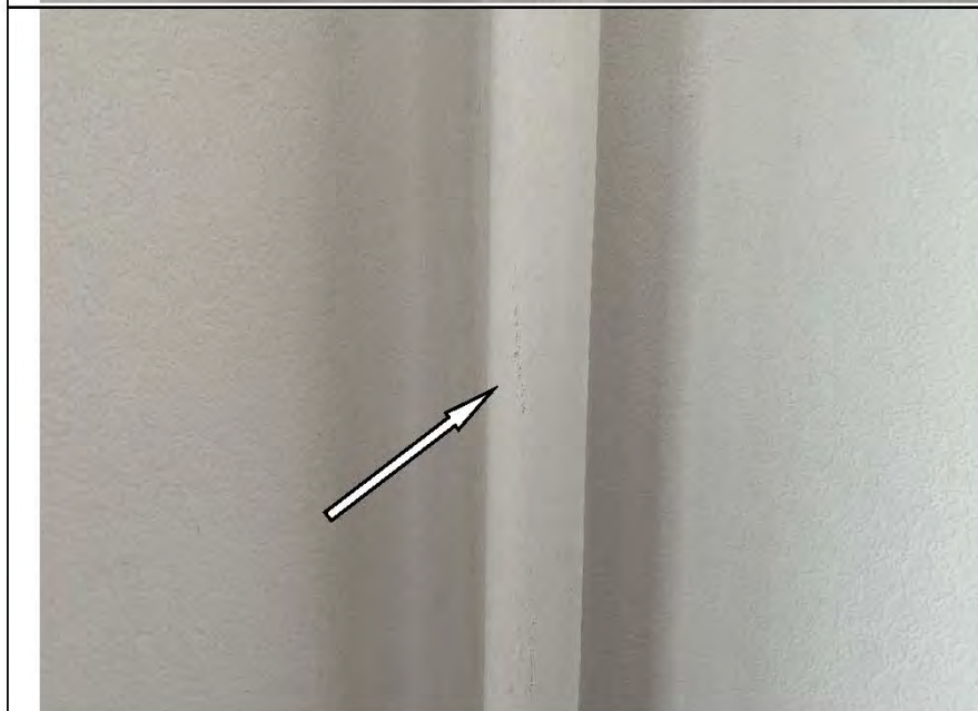
Фото №81. Окрашивание труб отопления выполнено с дефектами в спальне.
