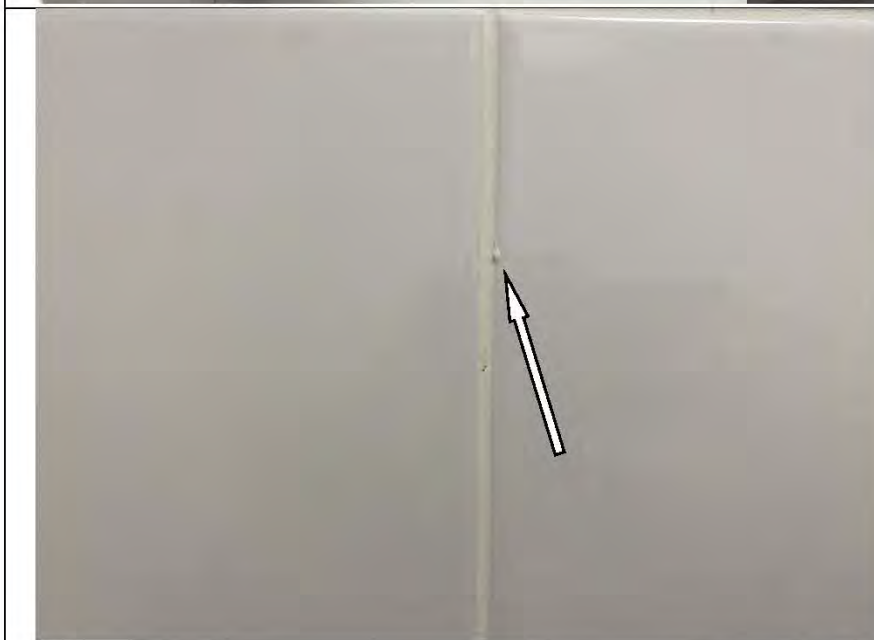
Фото №41. Загрязнение затирочным раствором настенной керамической плитки в санузле.
