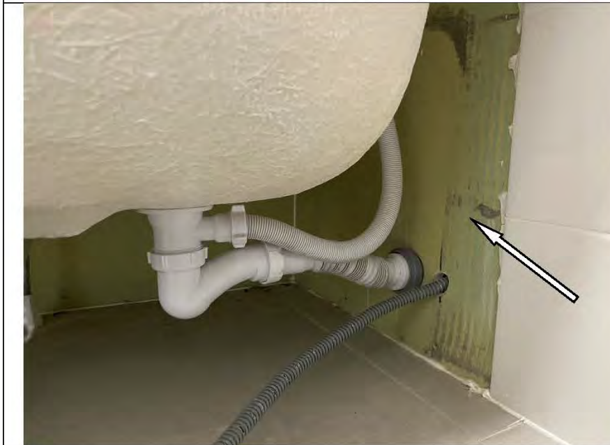
Фото №35. Частично отсутствует настенная керамическая плитка за ванной.
