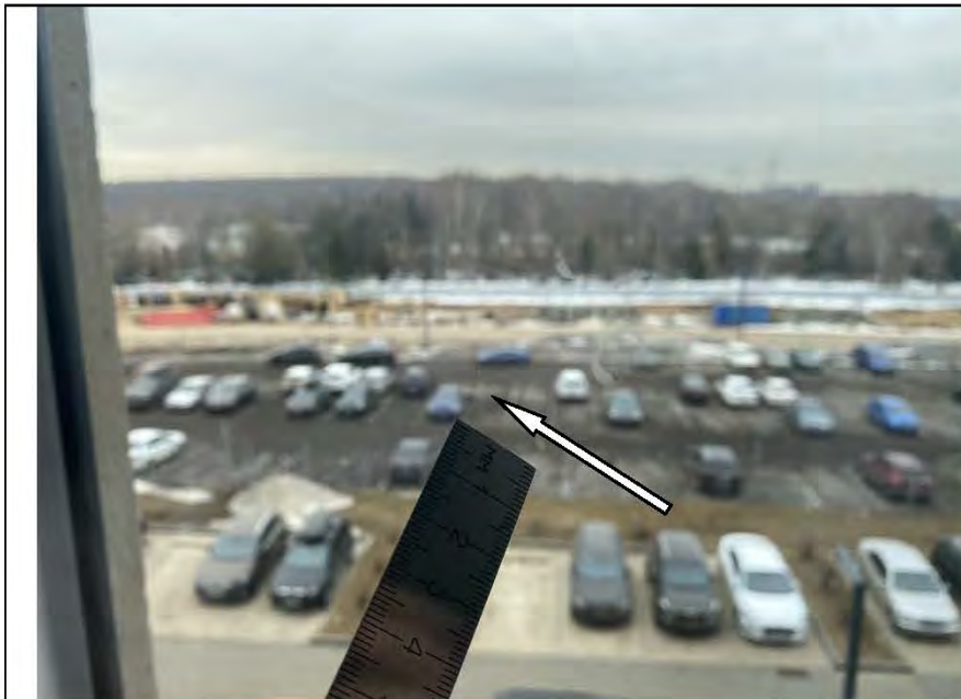
Фото №55. Царапины на стеклопакете оконного блока ПВХ в гостиной.
