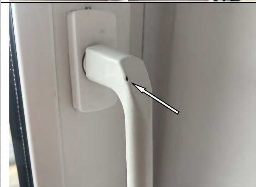
Фото №60. Царапины на фурнитуре оконного блока ПВХ в гостиной (ручке).
