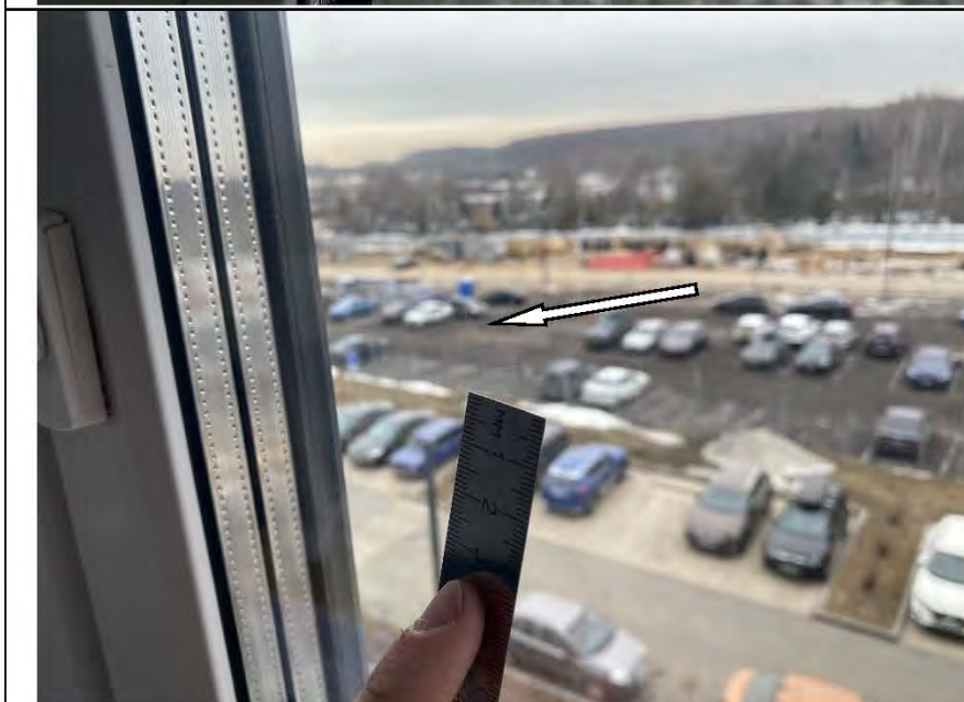
Фото №57. Царапины на стеклопакете оконного блока ПВХ в спальне.
