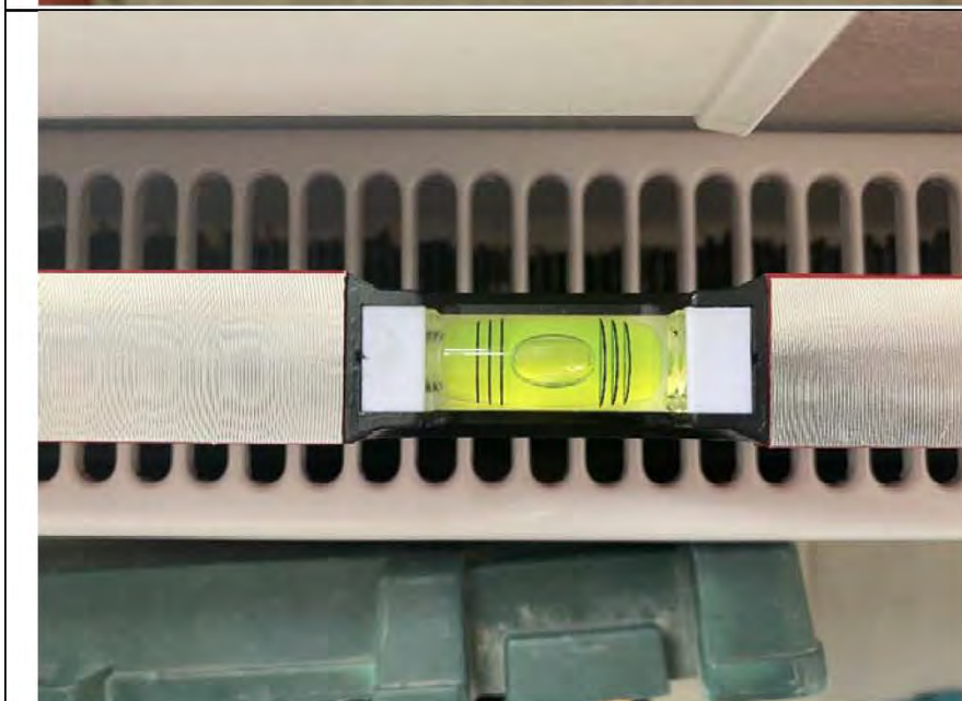
Фото №78. Отопительный прибор смонтирован неровно в кухне.
