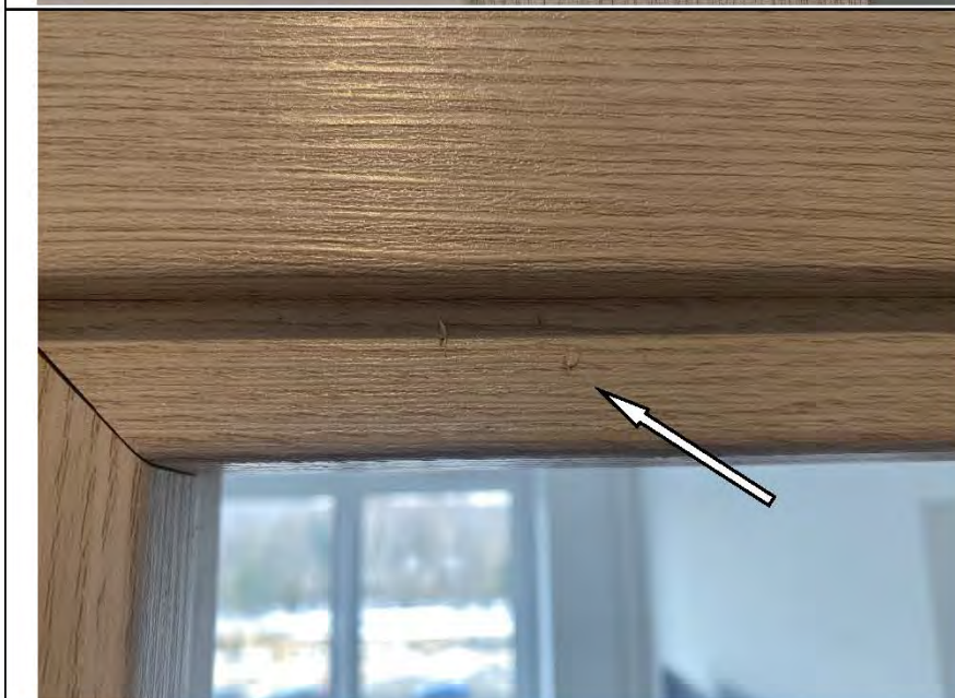
Фото №30. Сколы на поверхности дверной коробки в спальне.
