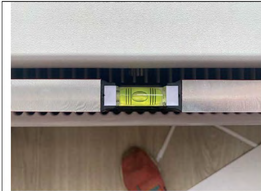
Фото №79. Отопительный прибор смонтирован неровно в кухне.
