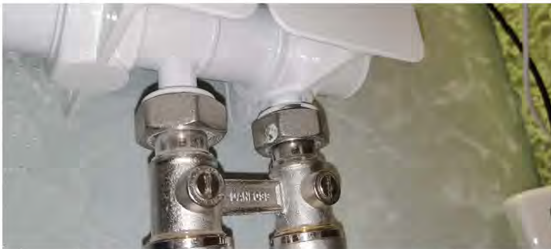
Рис. 1. Фотография места соединения радиатора и подводки.
