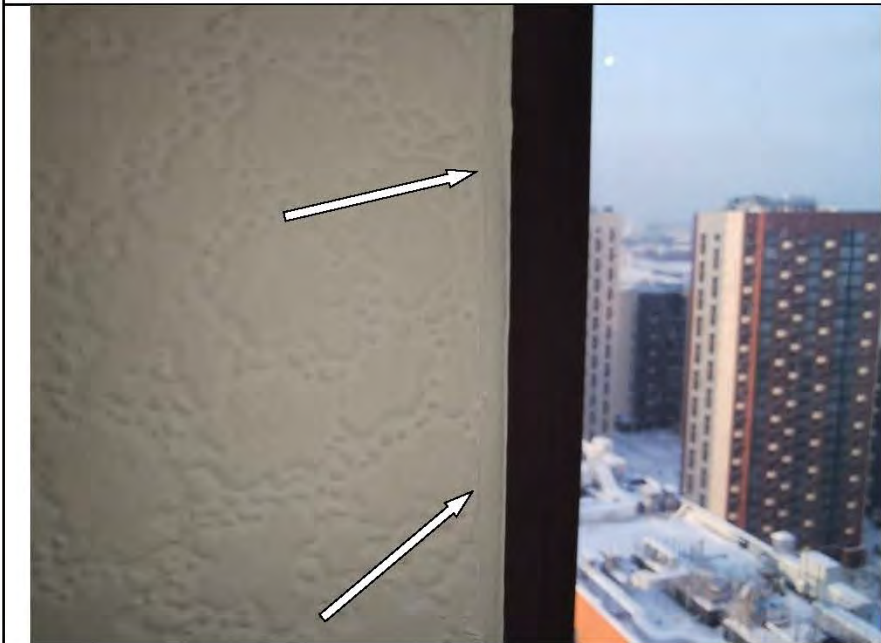
Фото №12. Неровно обрезано обойное полотно на стыке с оконным проемом в комнате.
