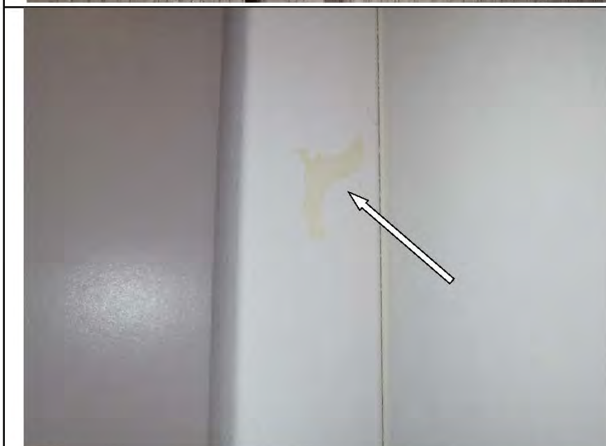
Фото №38. Загрязнение короба входного дверного блока.
