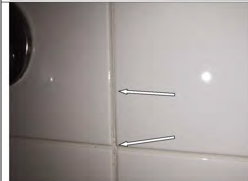
Фото №15. Некачественно выполнена затирка настенной керамической плитки в санузле.
