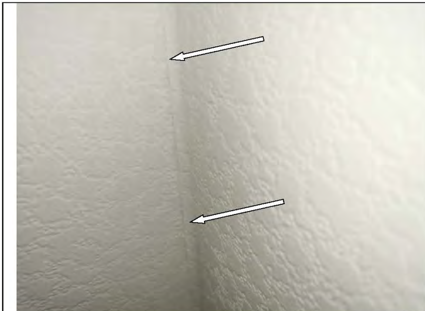
Фото №7. Читаемые обойные стыки, загрязнение обойного полотна в коридоре.
