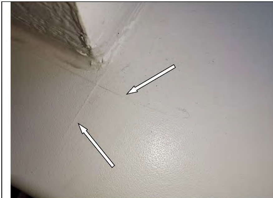
Фото №28. Царапины на лицевой стороне подоконной доски в комнате.
