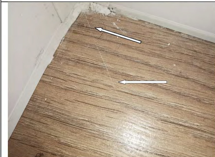
Фото №17. Царапины на напольном покрытии из ламината в комнате.
