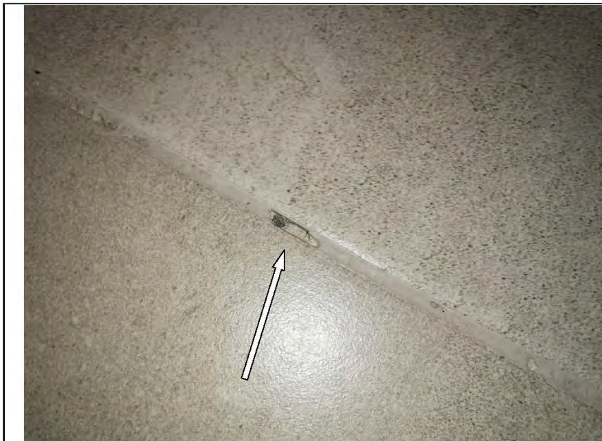
Фото №22. Некачественно выполнена затирка напольной керамической плитки в коридоре.
