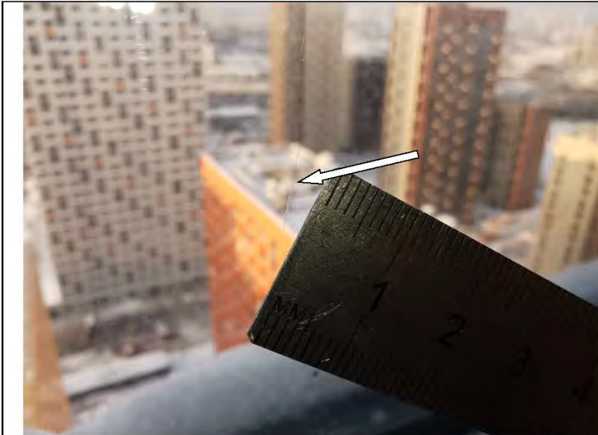
Фото №34. Царапины на стеклопакете оконного блока ПВХ в комнате.
