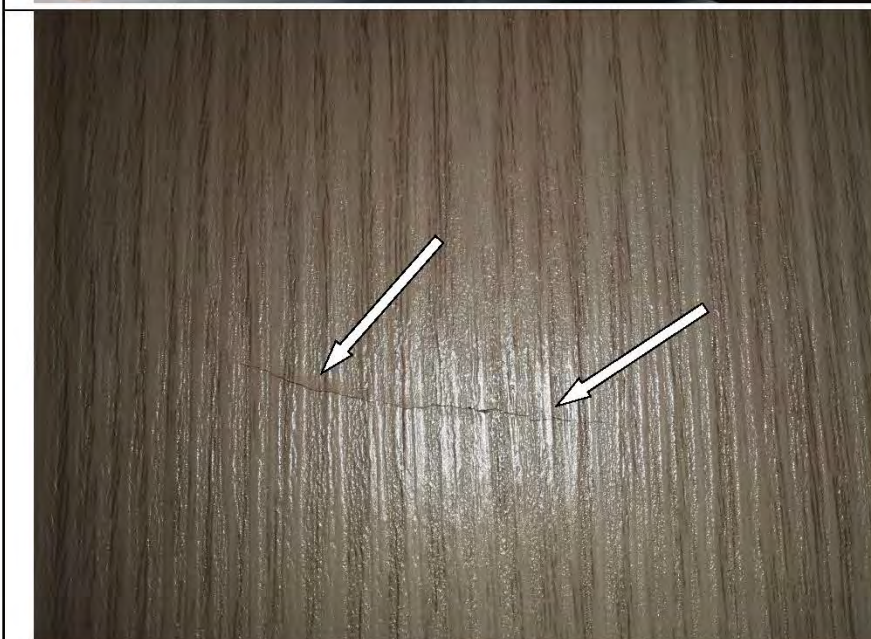
Фото №35. Повреждение ламинации полотна деревянного дверного блока в санузле.
