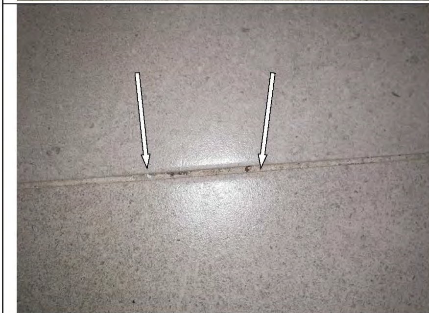
Фото №23. Некачественно выполнена затирка напольной керамической плитки в санузле.
