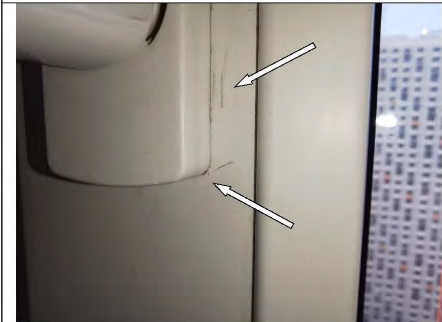
Фото №32. Царапины на профиле ПВХ оконного блока в комнате.
