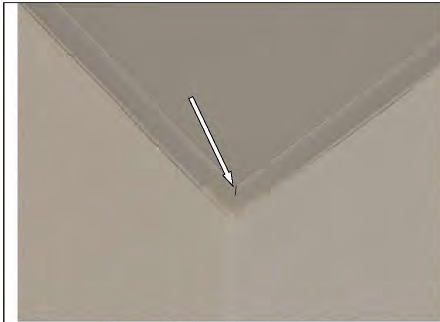
Фото №25. Дефект монтажа декоративного молдинга крепления натяжного потолка в коридоре.
