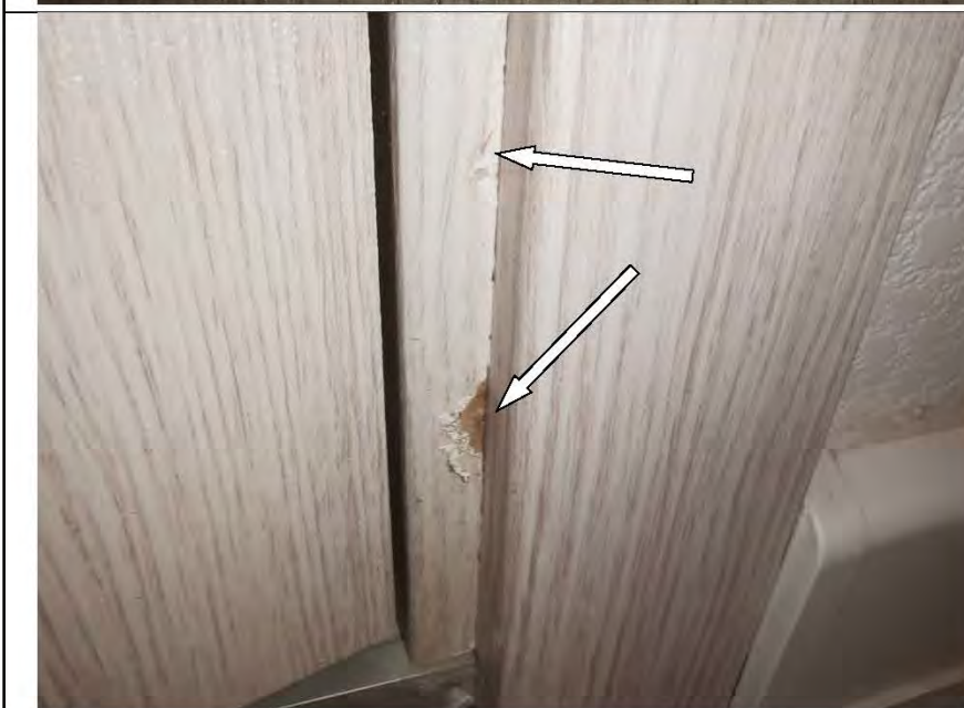
Фото №36. Повреждение ламинации короба деревянного дверного блока в санузле.
