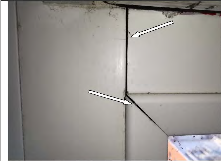
Фото №31. Зазор в месте стыка профилей ПВХ оконного блока в комнате.
