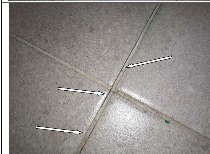
Фото №24. Некачественно выполнена затирка напольной керамической плитки в санузле.
