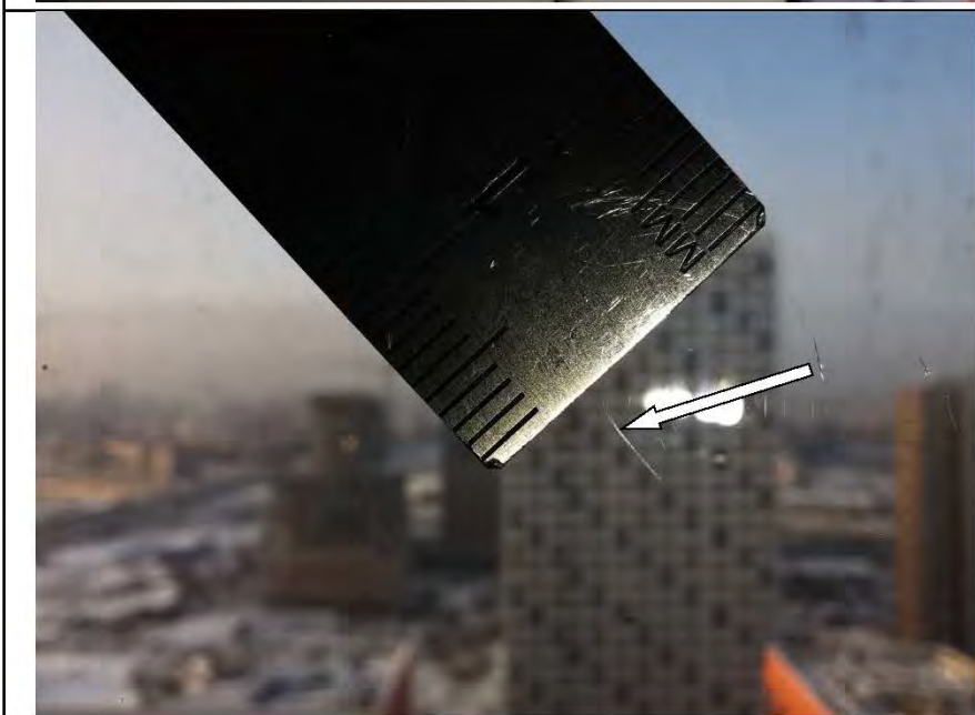
Фото №33. Царапины на стеклопакете оконного блока ПВХ в комнате.
