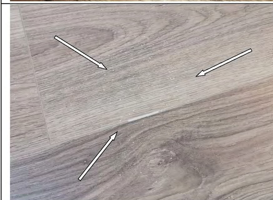
Фото №18. Загрязнения на напольном покрытии из ламината в комнате.
