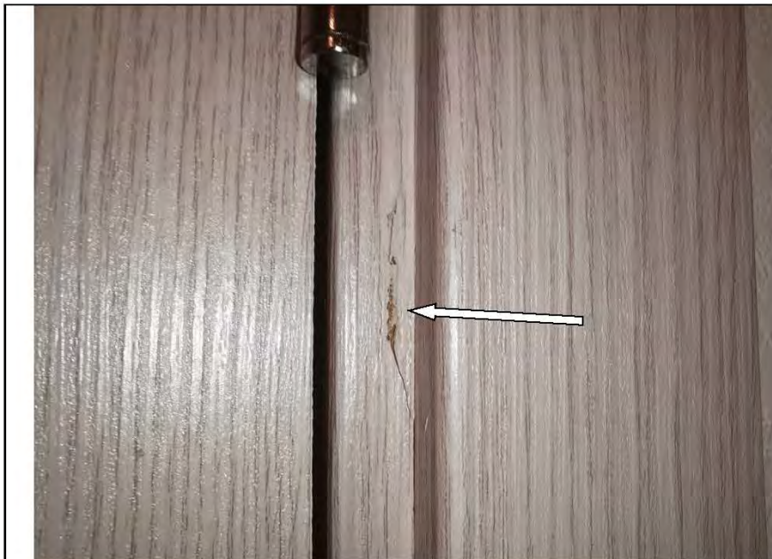
Фото №37. Трещина на коробе деревянного дверного блока в санузле.
