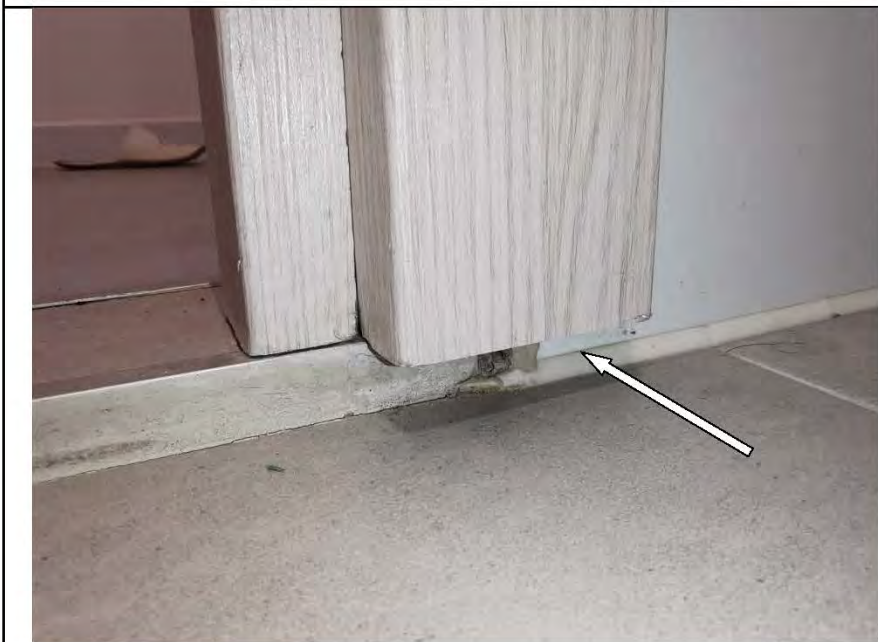
Фото №41. Коротко подрезаны наличники деревянного дверного блока в санузле.
