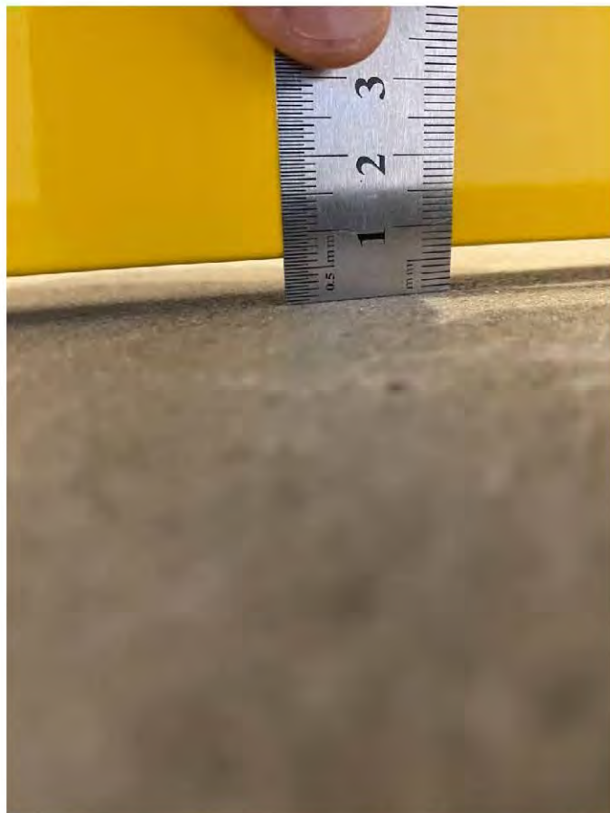
Фото 52. Ванная. 6.3 Отклонения напольного покрытия из керамической плитки от плоскости при проверке двухметровой контрольной рейкой 6,5 мм
