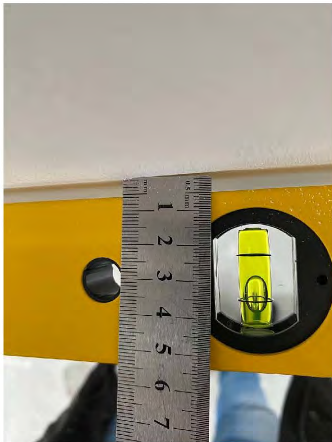
Фото 42. Комната 1. 4.5 Отклонения участка стены от горизонтали 5 мм
