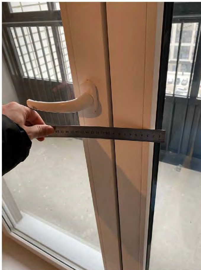
Фото 24. Кухня. 2.3 При открывании и закрывании обнаружено отклонение в работе одной оконной створки
