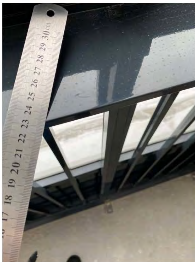
Фото 31-33. Лоджия. 3.3 На лицевых поверхностях оконного блока имеются сколы, царапины
