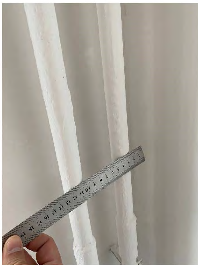
Фото 55. Комната 2. 7.1 Некачественная окраска труб отопления: разводы
