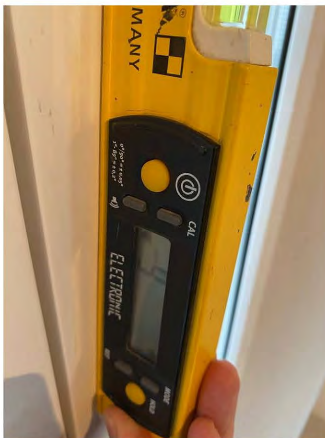
Фото 23. Кухня. 2.2 Отклонение оконного блока от вертикали 6 мм
