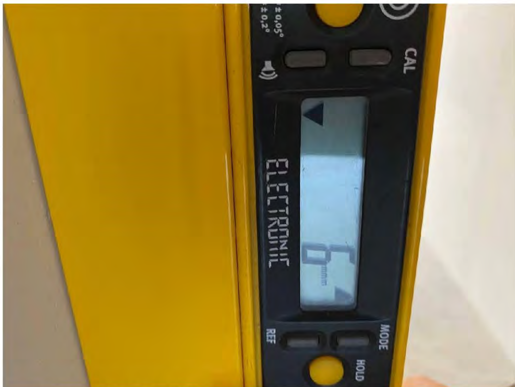
Фото 20. Коридор. 1.3 Отклонения участка стены от вертикали 6 мм
