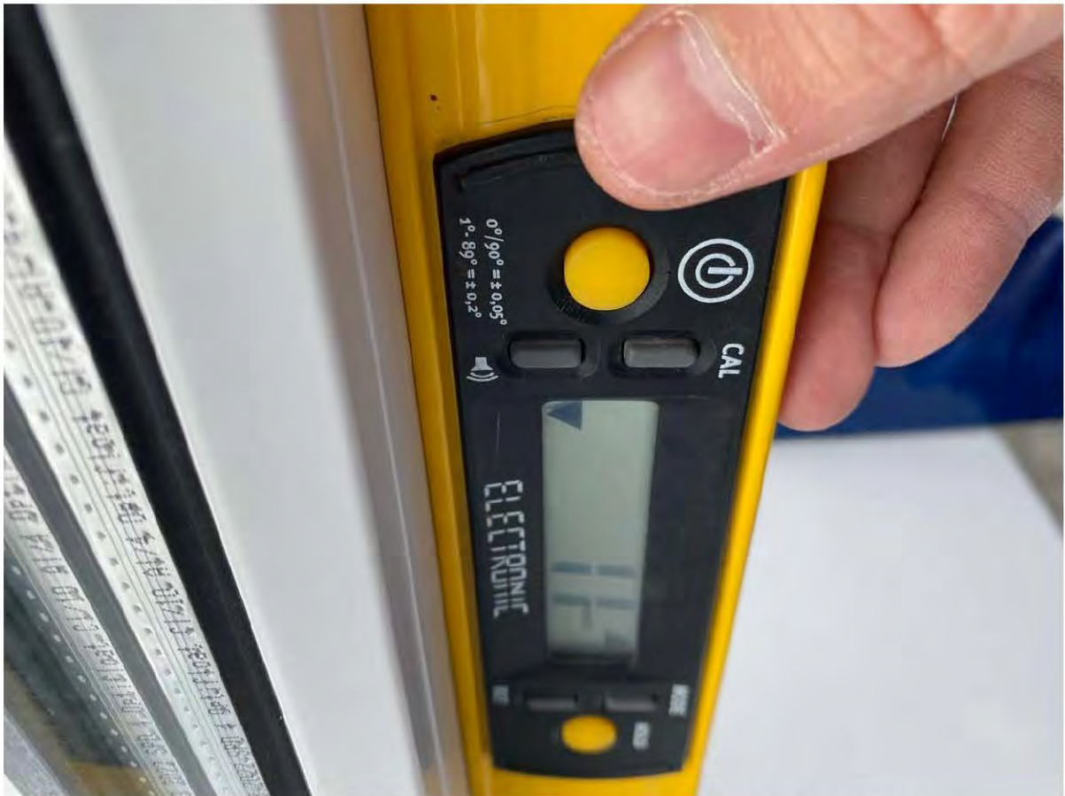
Фото 59. Комната 2. 7.4 Отклонение оконного блока от вертикали 11 мм
