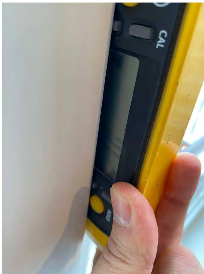
Фото 39. Комната 1. 4.2 Отклонение оконного блока от вертикали 10 мм
