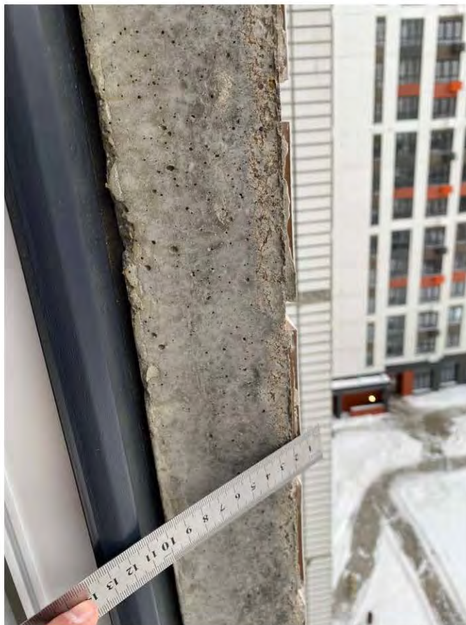
Фото 44. Комната 1. 4.7 Отсутствует герметизация у оконного блока с фасадной части
