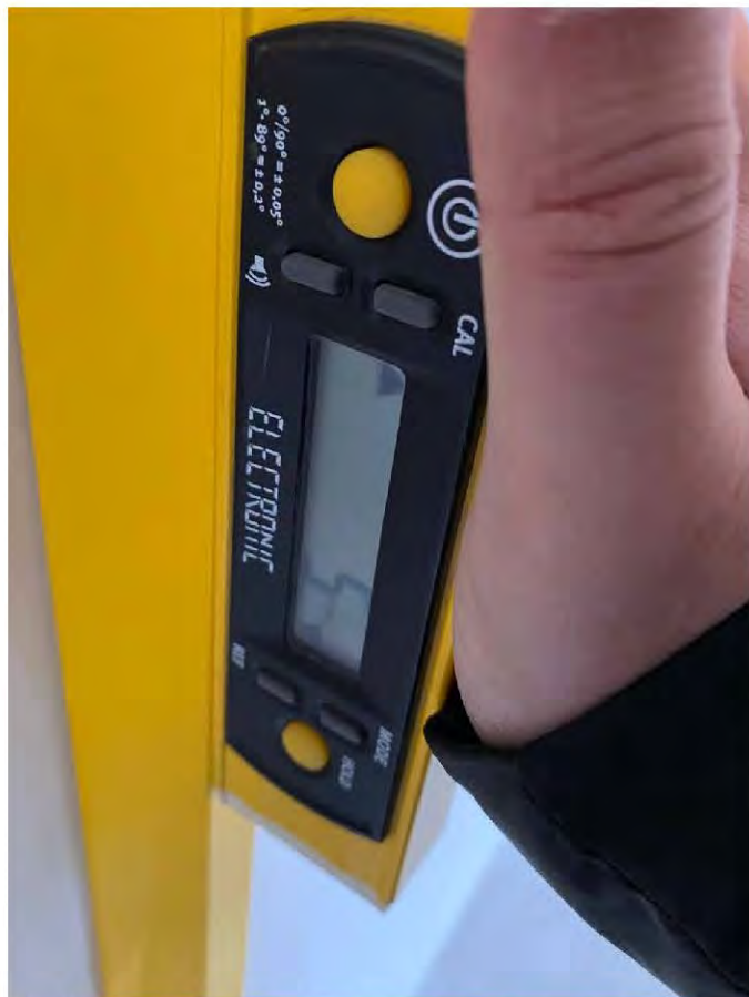
Фото 26. Кухня. 2.5 Отклонения участка стены от вертикали 5 мм
