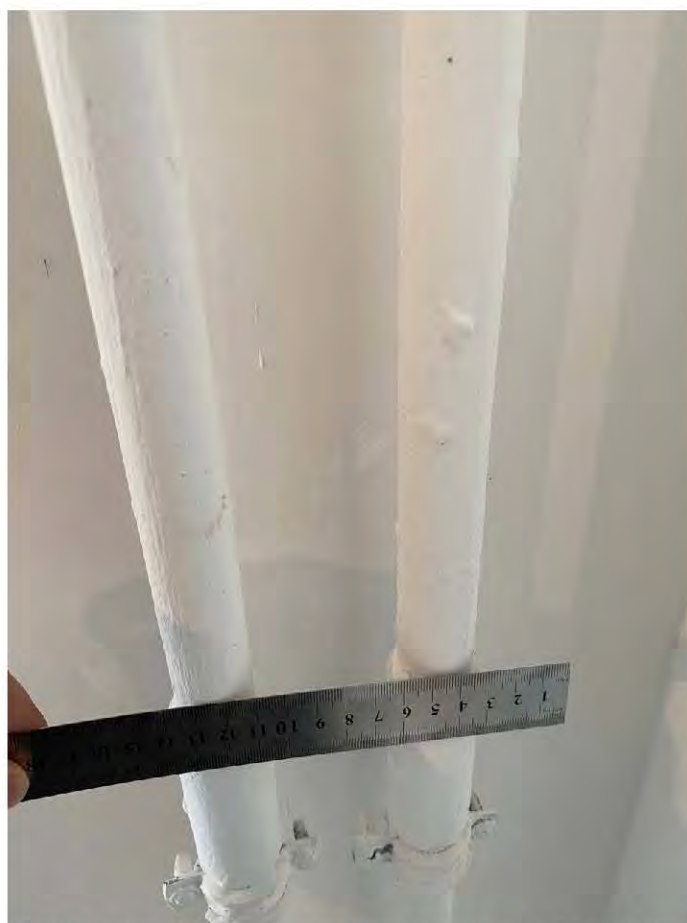
Фото 43. Комната 1. 4.6 Некачественная окраска труб отопления: разводы
