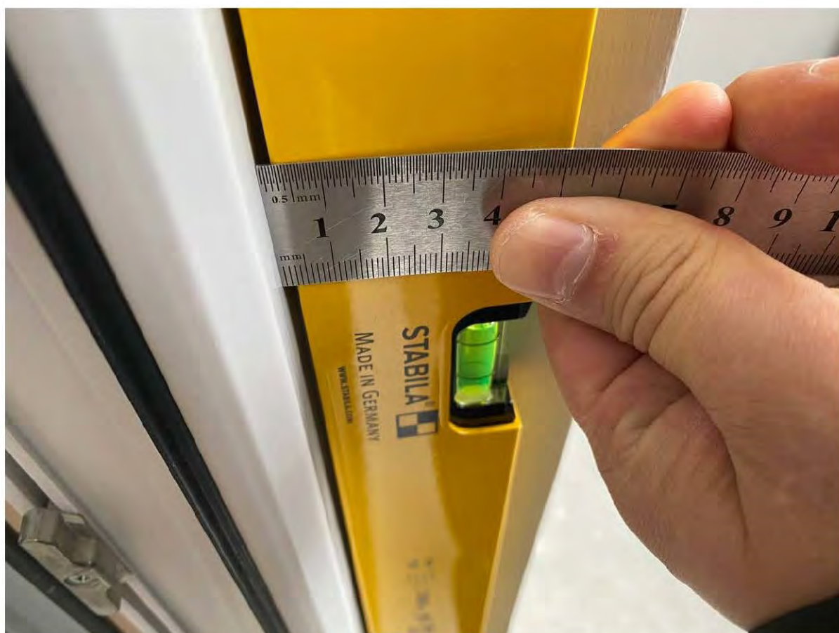
Фото 25. Кухня. 2.4 Отклонение оконного блока от плоскости 3 мм
