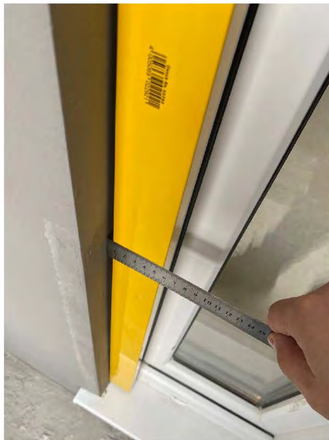
Фото 30. Лоджия. 3.2 Отклонение оконного откоса от горизонтали 6 мм
