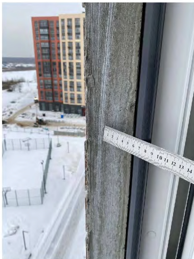
Фото 58. Комната 2. 7.3 Отсутствует герметизация у оконного блока с фасадной части
