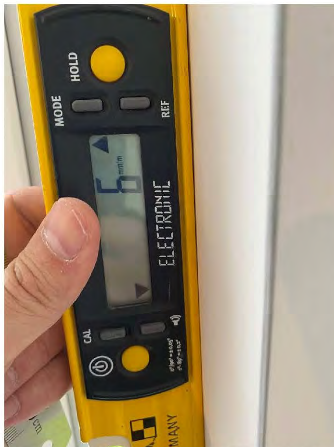
Фото 41. Комната 1. 4.4 Отклонение оконного откоса от вертикали 6 мм
