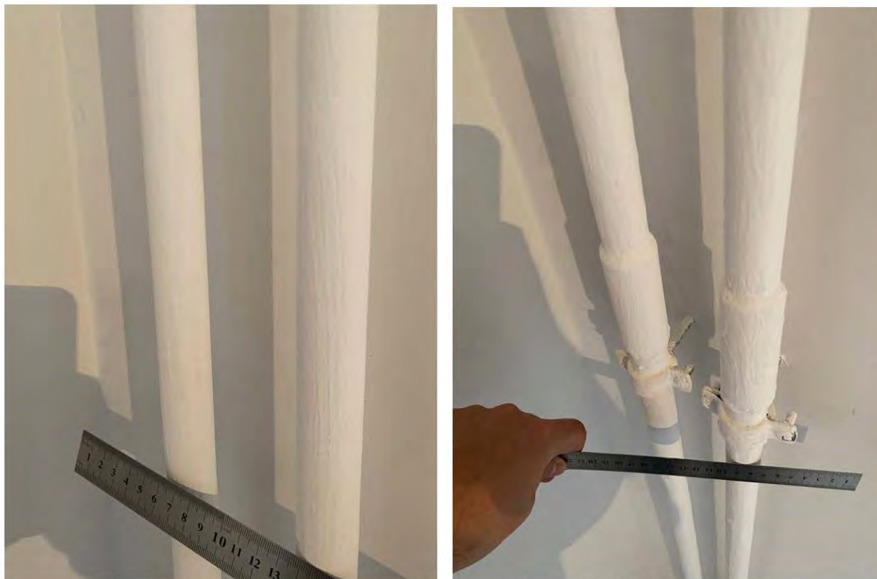
Фото 21, 22. Кухня. 2.1 Некачественная окраска труб отопления: разводы
