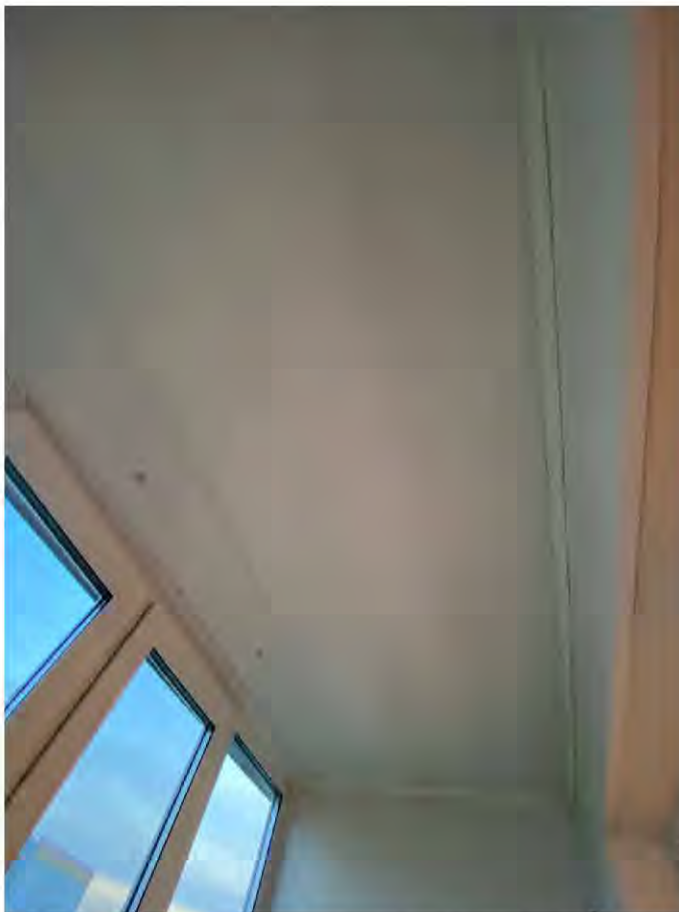
Фото 33. Лоджия. Стены, потолок, пострадавшие от залива: разводы, образование зазоров
