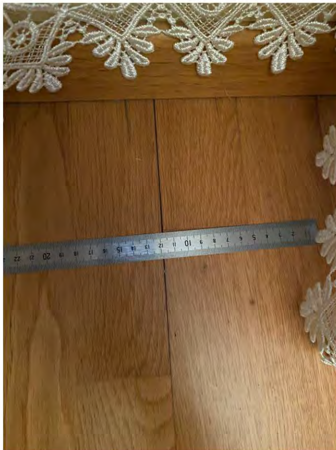
Фото 22-24. Комната 1. Пол, образование зазоров, набухание кромок паркета
