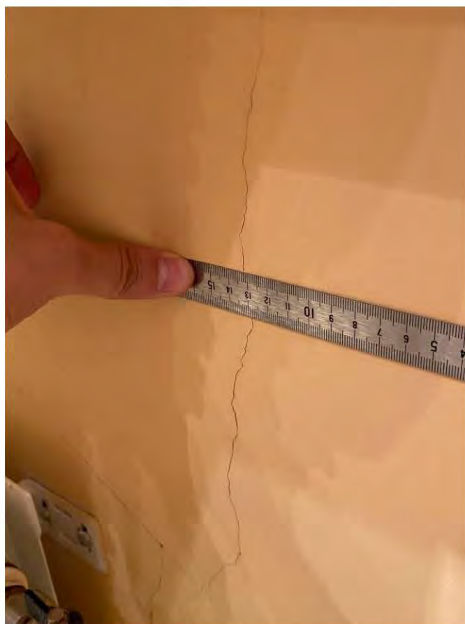
Фото 10-12. Кухня. Трещины по стене, возникшие в результате залива
