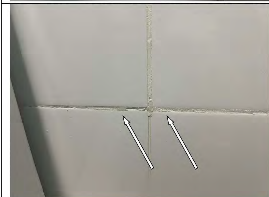
Фото №15. Наплывы затирочного раствора в шовном пространстве настенной керамической плитки в ванной комнате.
