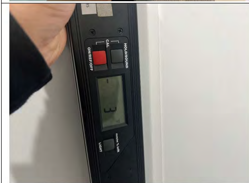
Фото №57. Отклонение наличников входного дверного по уровню вертикальности составляет 3 мм.
