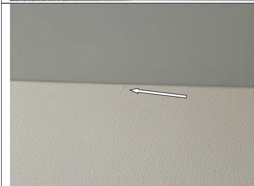
Фото №11. Отслоение обоевого полотна в кухне.
