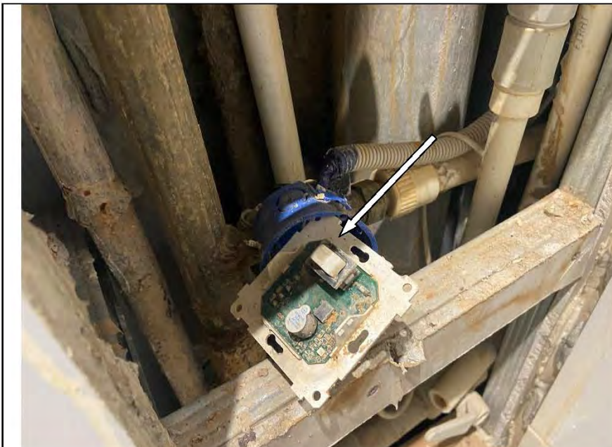
Фото №28. Отсутствует заземление в санузле в квартире.
