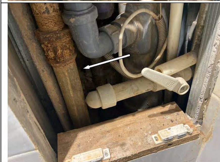
Фото №26. Трубы водоснабжения не закреплены должным образом в результате залива в санузле в квартире.
