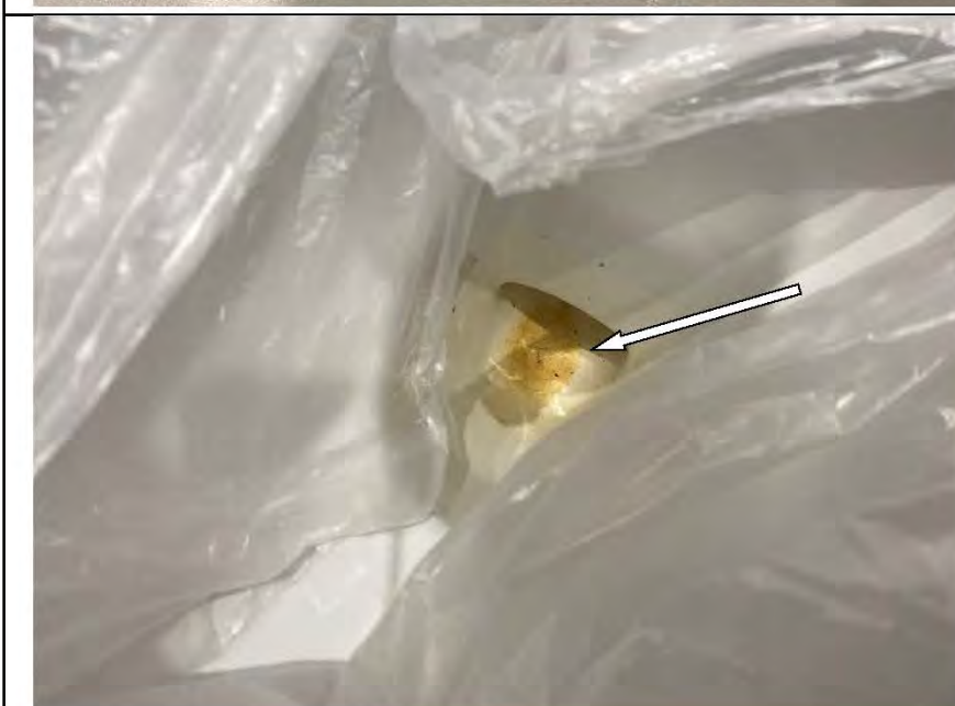
Фото №24. Загрязнения на унитазе в санузле в квартире.
