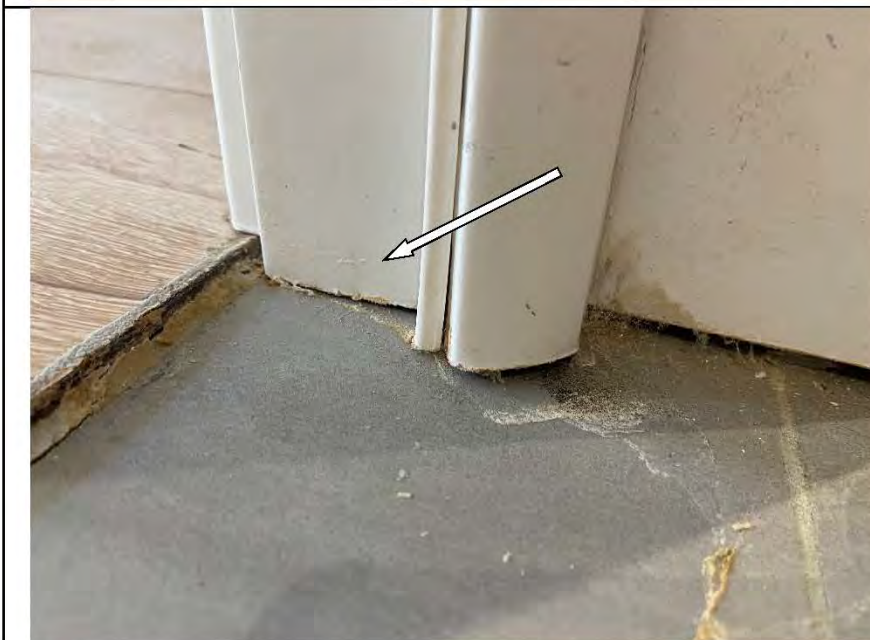
Фото №5. Коробка деревянного дверного блока имеет дефекты (отслоение ламинации от вздутия) в санузле, характерное последствиям залива.
