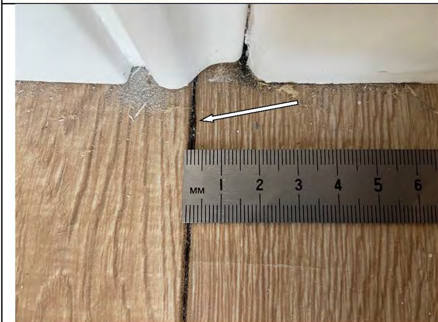
Фото №11. Зазор между досками ламината в результате залива в комнате в квартире.
