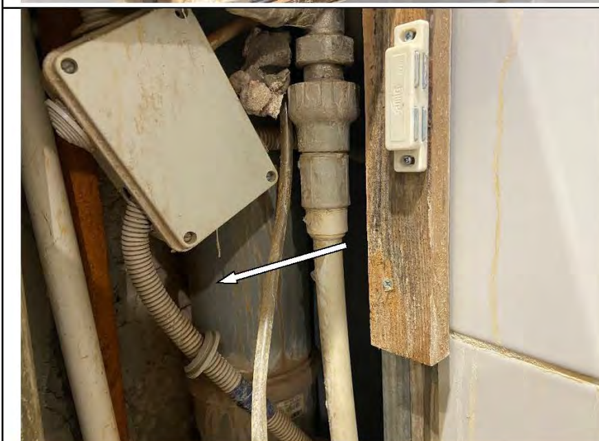
Фото №27. Трубы водоснабжения не закреплены должным образом в результате залива в санузле в квартире.
