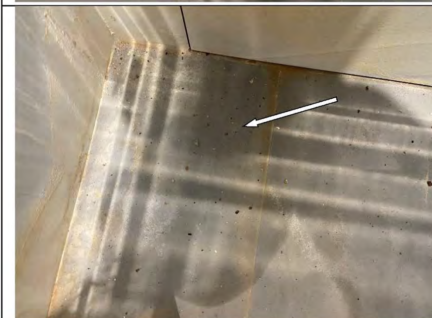
Фото №21. Следы заливия, загрязнения, расслоения, пустоты в швах напольной керамической плитке в санузле в квартире.
