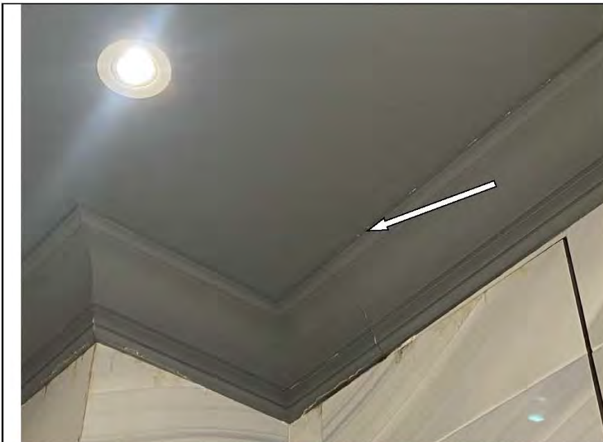
Фото №4. Следы заливия, отслоения, загрязнения на оштукатуренном и покращенном потолке в санузле в квартире.
