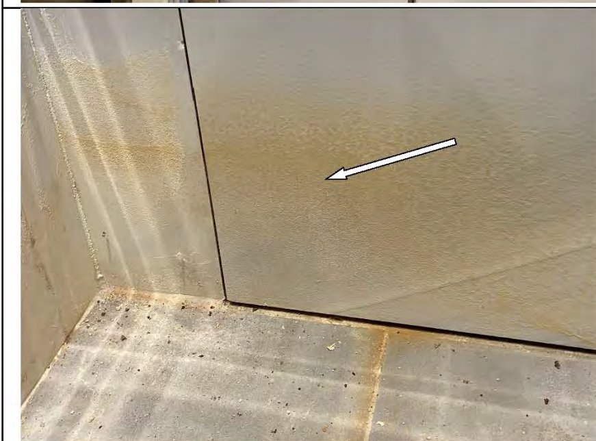
Фото №18. Следы заливия, загрязнения, расслоения, пустоты в швах настенной керамической плитке в санузле в квартире.
