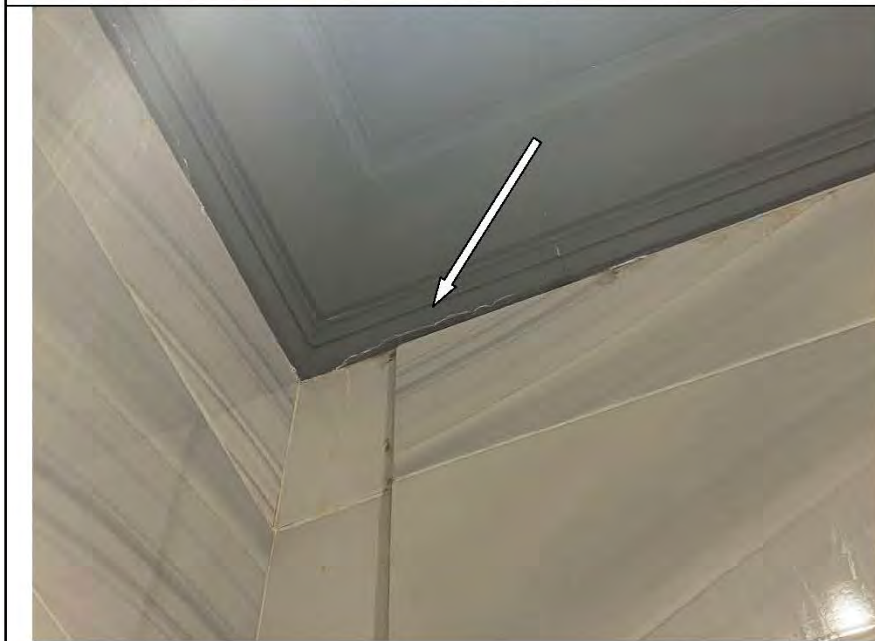
Фото №3. Следы залития, отслоения, загрязнения на оштукатуренном и покрашенном потолке в санузле в квартире.
