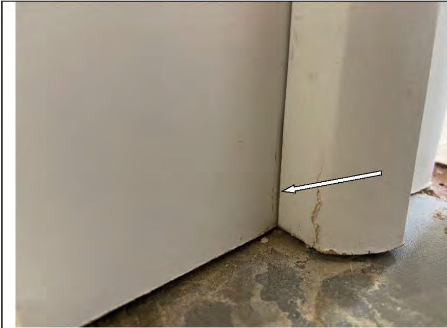
Фото №10. Полотно деревянного дверного блока имеет дефекты (отслоение ламинации от вздутия, загрязнения) в санузле, характерное последствиям залива.
