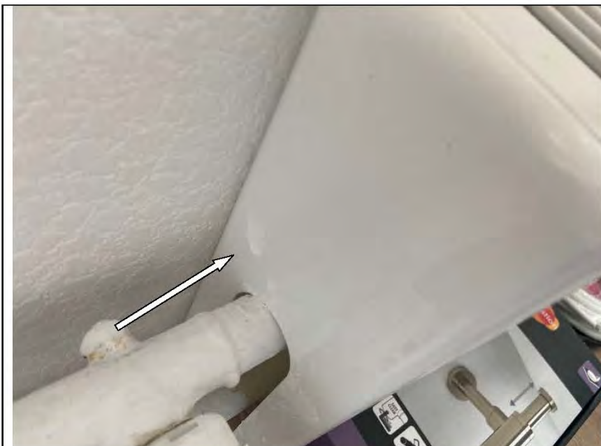
Фото №88. Дефект на металлическом кожухе отопительного прибора в спальне.
