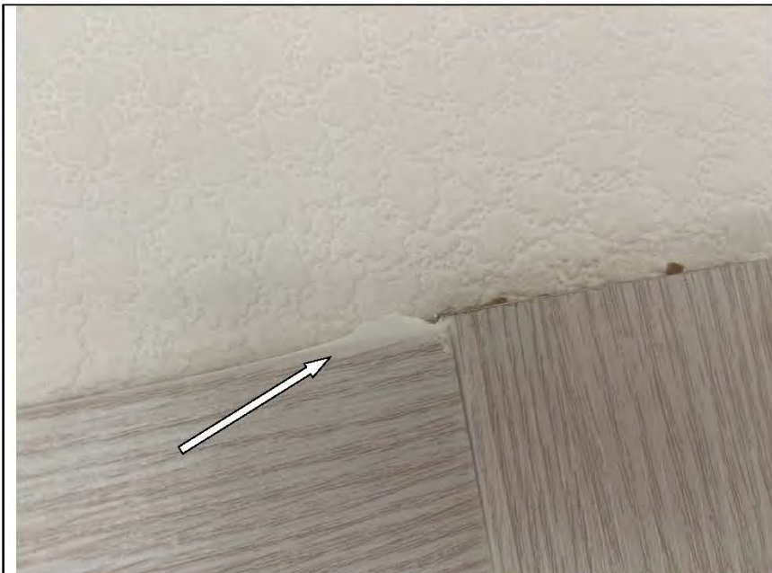
Фото №73. Загрязнения на наличниках деревянного дверного блока в спальне.
