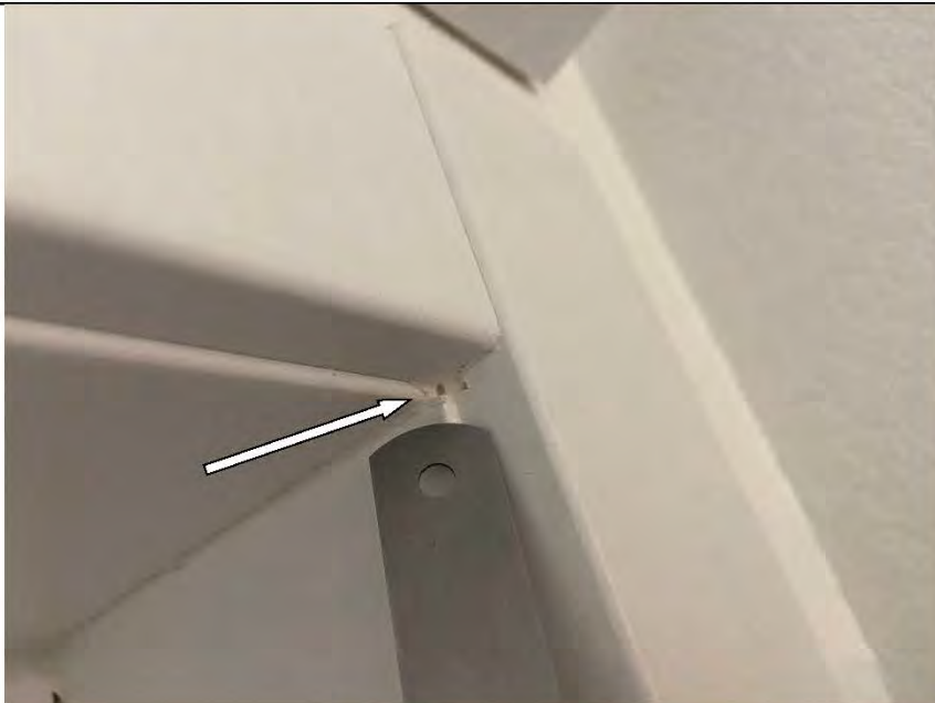
Фото №62. Загрязнения на коробке входного дверного блока в прихожей.
