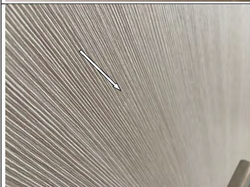
Фото №65. Загрязнения на полотне деревянного дверного блока в санузле.
