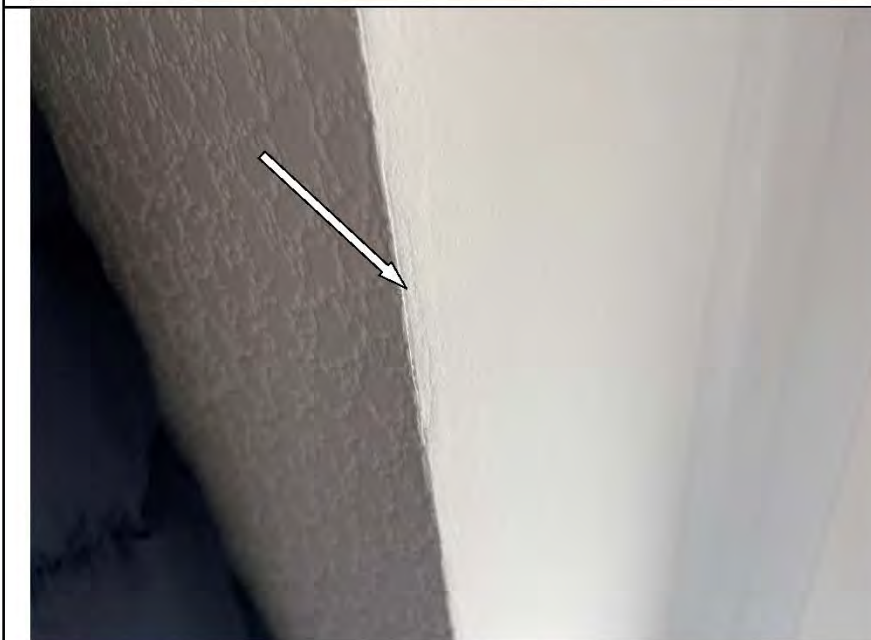
Фото №47. Неровности, сколы, выбоины на окрашенных откосах оконного блока ПВХ в спальне.
