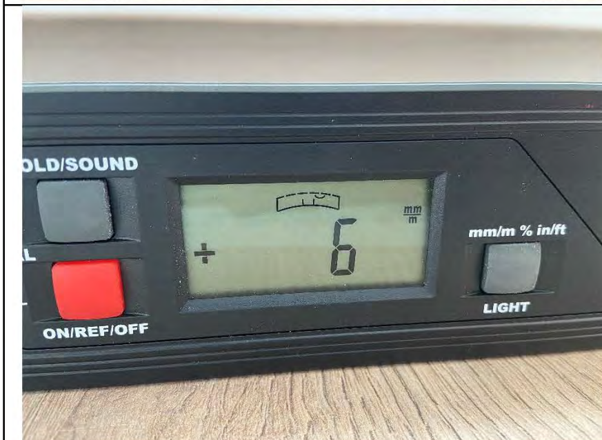
Фото №23. Отклонения напольного покрытия из ламината в кабинете.
