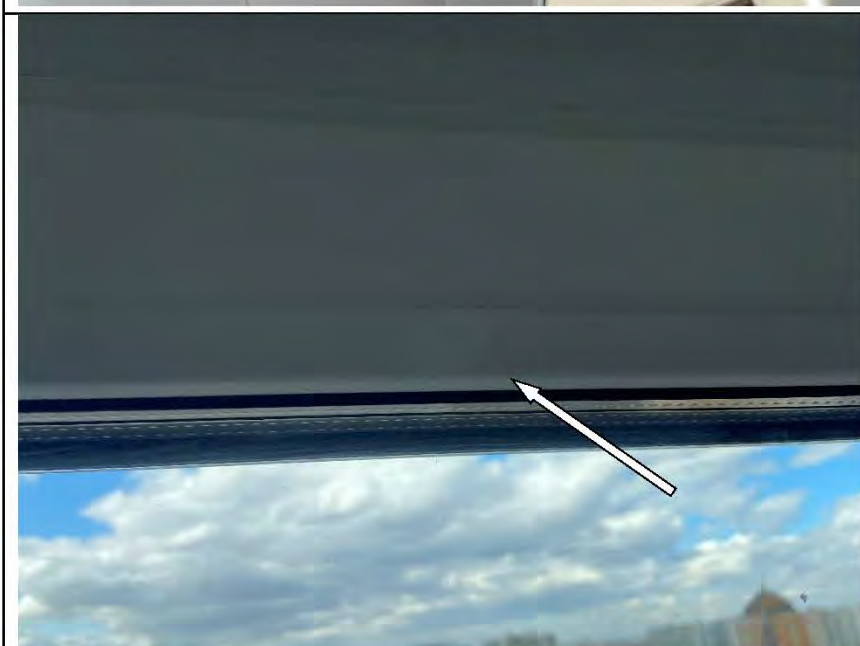
Фото №51. Загрязнения на профиле оконного блока ПВХ в кабинете.
