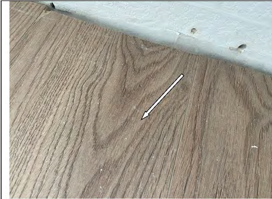
Фото №37. Дефекты на ламинате в кабинете.
