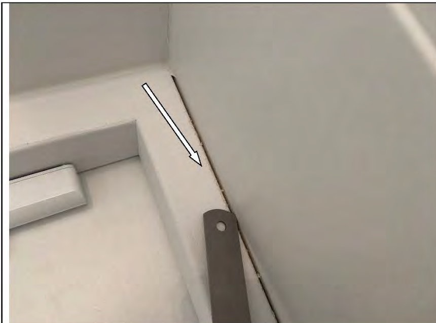
Фото №61. Дефект на коробке входного дверного блока в прихожей.
