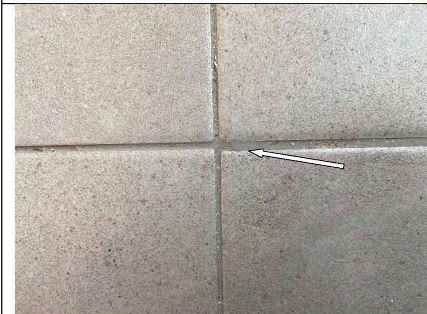
Фото №35. Неровные швы напольной керамической плитки в кухне.
