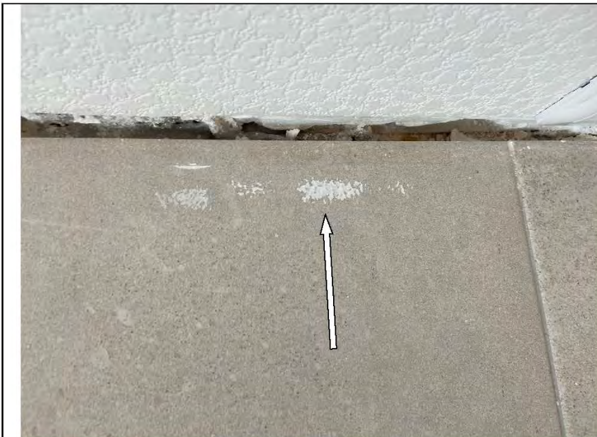
Фото №31. Загрязнения на напольной керамической плитке в кухне.
