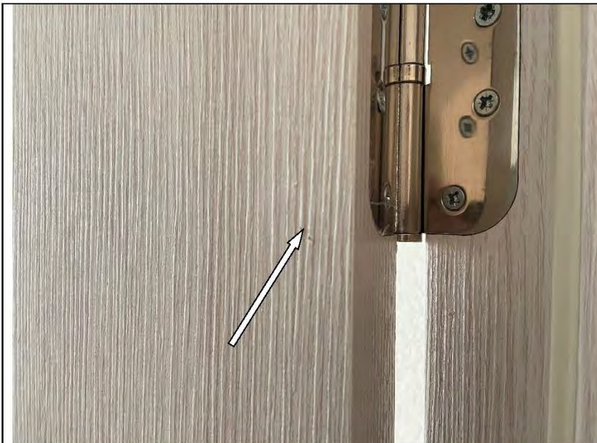
Фото №67. Загрязнения на полотне деревянного дверного блока в спальне.
