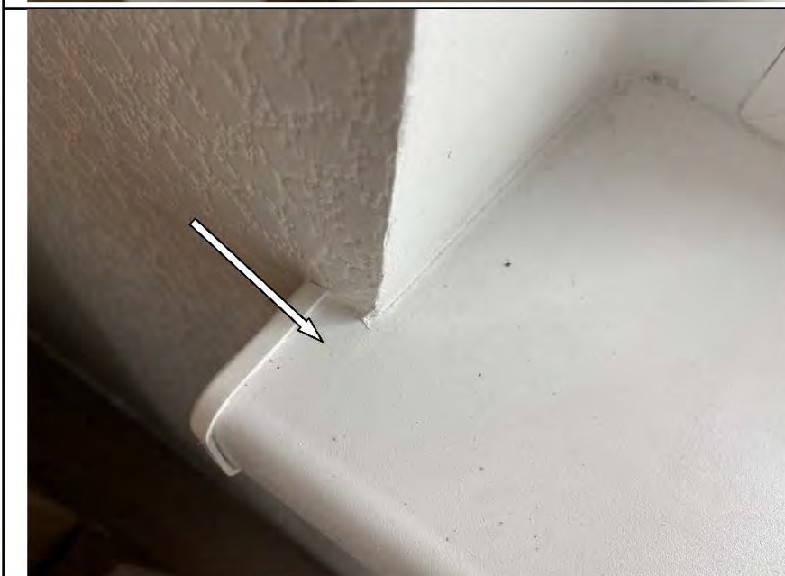
Фото №45. Царапина на лицевой стороне подоконной доски в кабинете.
