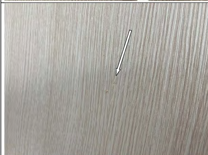
Фото №68. Загрязнения на полотне деревянного дверного блока в кабинете.
