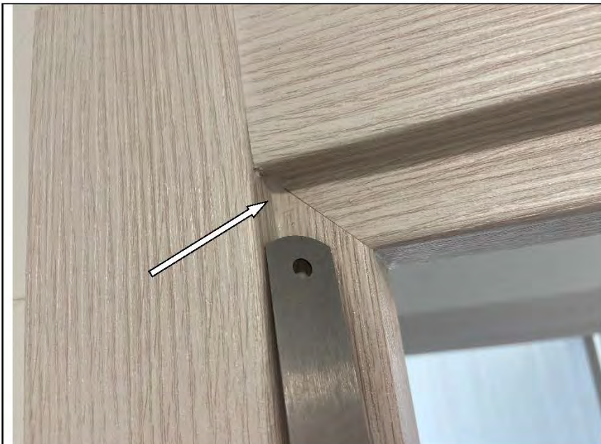
Фото №76. Дефект на коробке деревянного дверного блока в ванной комнате.
