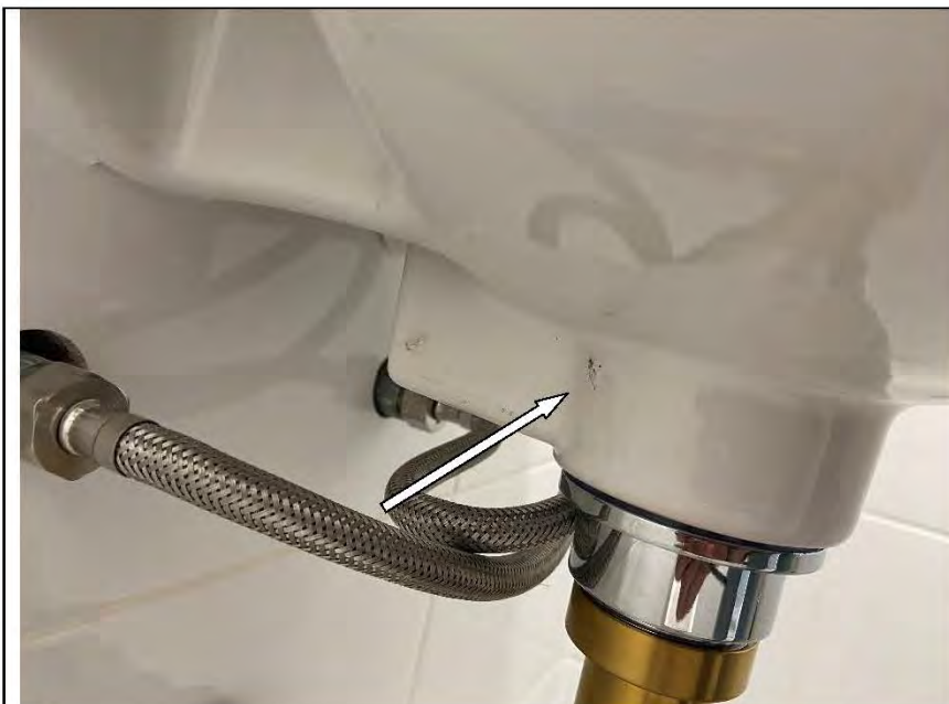
Фото №91. Царапина на раковине в санузле.
