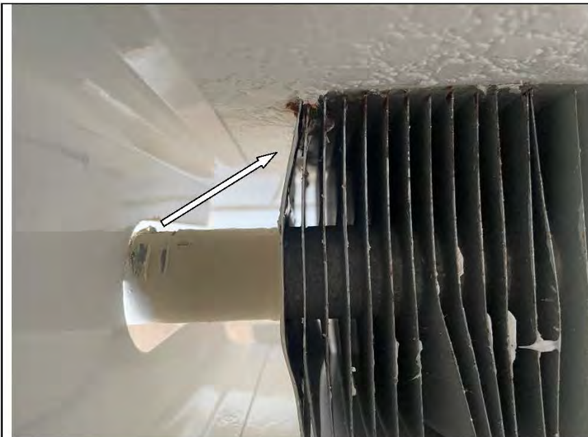
Фото №85. Загиб радиатора в спальне.
