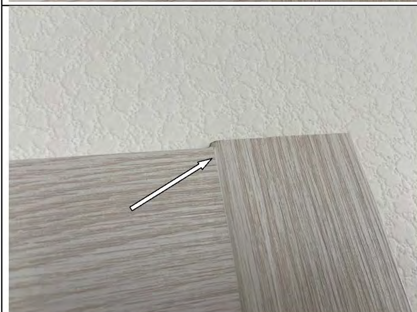
Фото №74. Загрязнения на наличниках деревянного дверного блока в кабинете.
