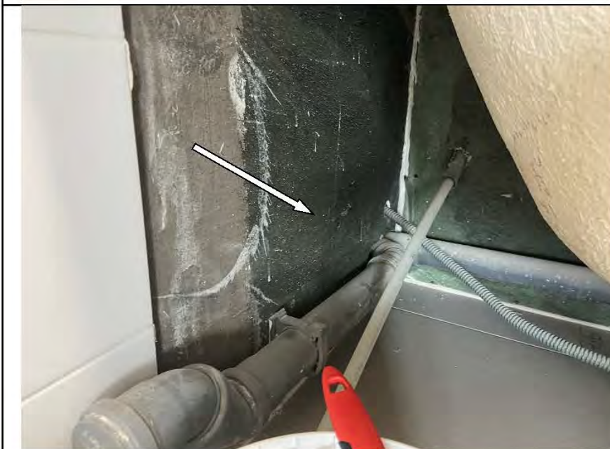
Фото №20. Частично не хватает настенной керамической плитки в ванной комнате.
