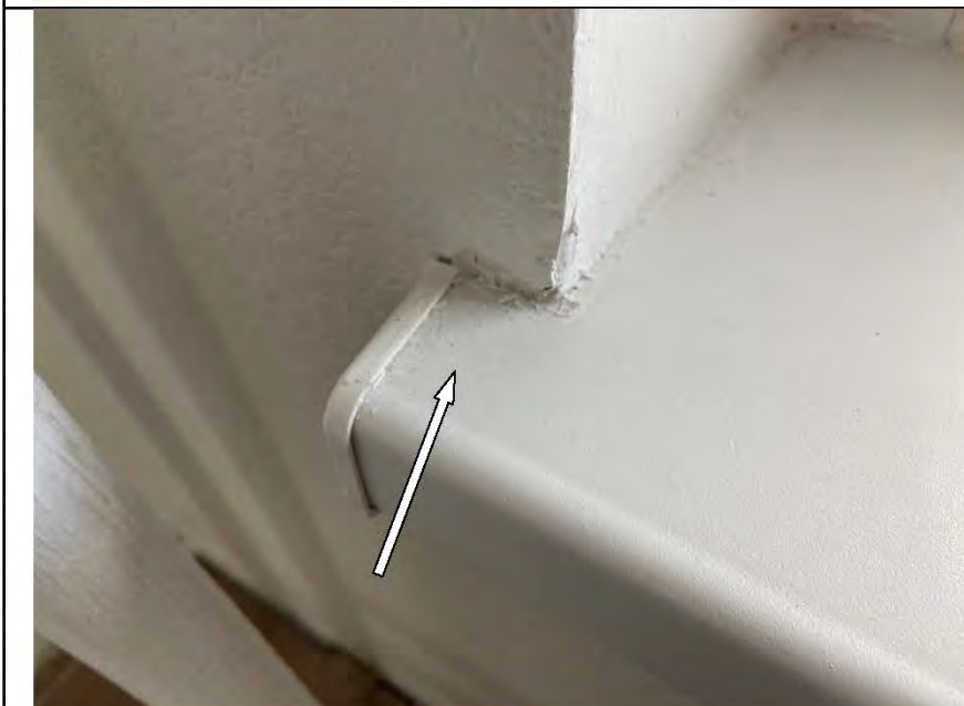
Фото №44. Царапина на лицевой стороне подоконной доски в кабинете.
