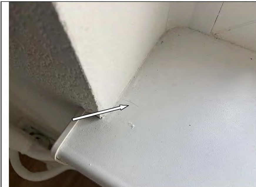
Фото №43. Царапина на лицевой стороне подоконной доски в спальне.
