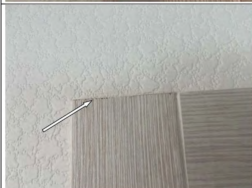
Фото №72. Сколы на наличниках деревянного дверного блока в ванной комнате.
