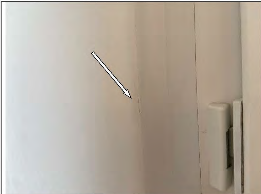
Фото №49. Неровности, сколы, выбоины на окрашенных откосах оконного блока ПВХ в кухне.
