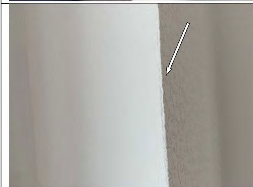
Фото №48. Неровности, сколы, выбоины на окрашенных откосах оконного блока ПВХ в кабинете.
