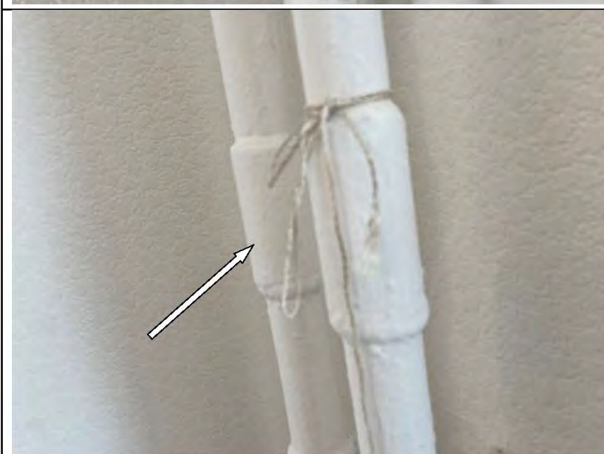
Фото №60. Неровности, подтеки на окрашенных трубах отопления в кухне.
