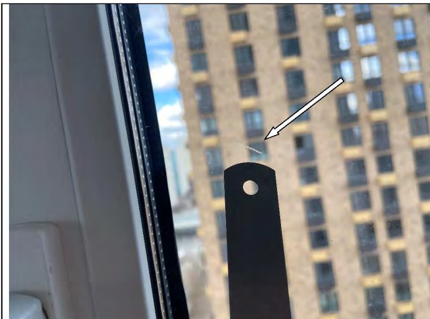
Фото №55. Дефект на стеклопакете оконного блока ПВХ в кабинете.
