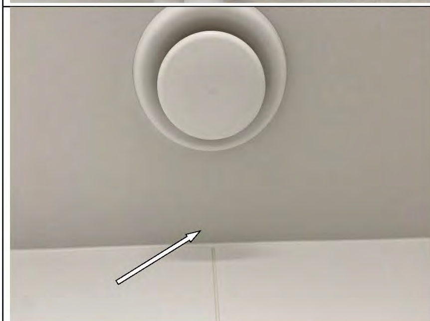
Фото №83. Загрязнения на подвесном потолке в санузле.
