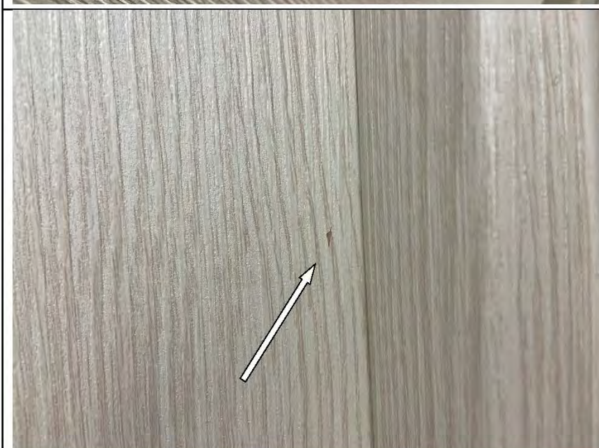
Фото №66. Скол на полотне деревянного дверного блока в ванной комнате.
