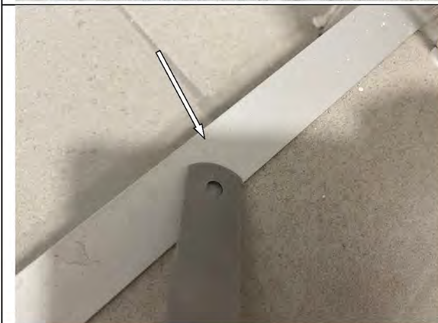
Фото №39. Царапины на напольном металлическом порожке в санузле.
