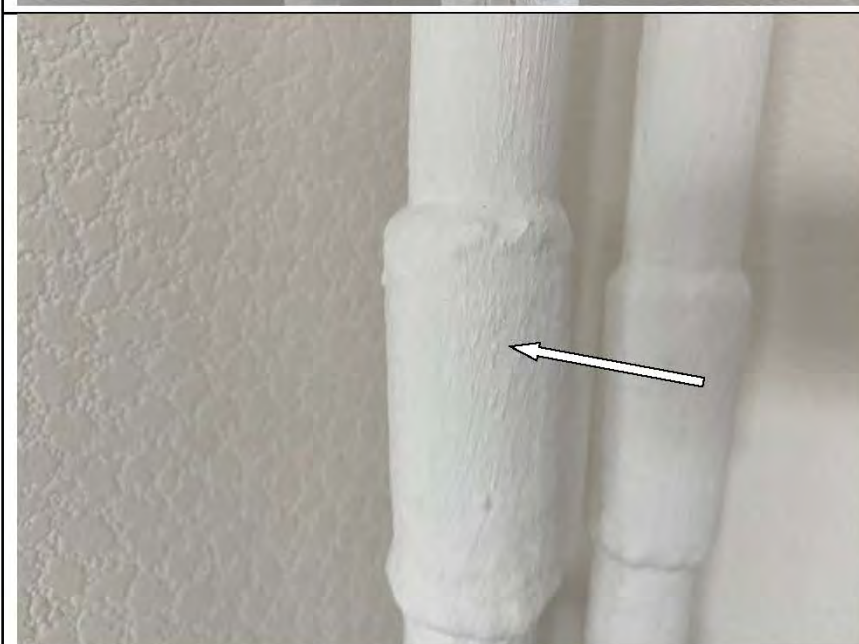
Фото №59. Неровности, подтеки на окрашенных трубах отопления в кабинете.
