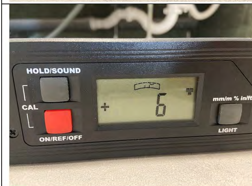
Фото №27. Отклонения напольного покрытия из керамической плитки в ванной комнате.
