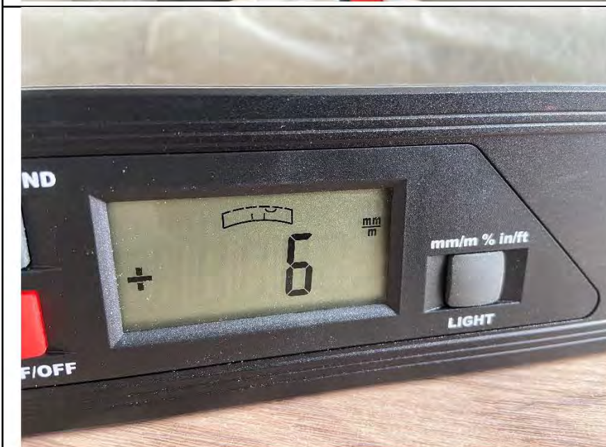
Фото №21. Отклонения напольного покрытия из ламината в кухне.
