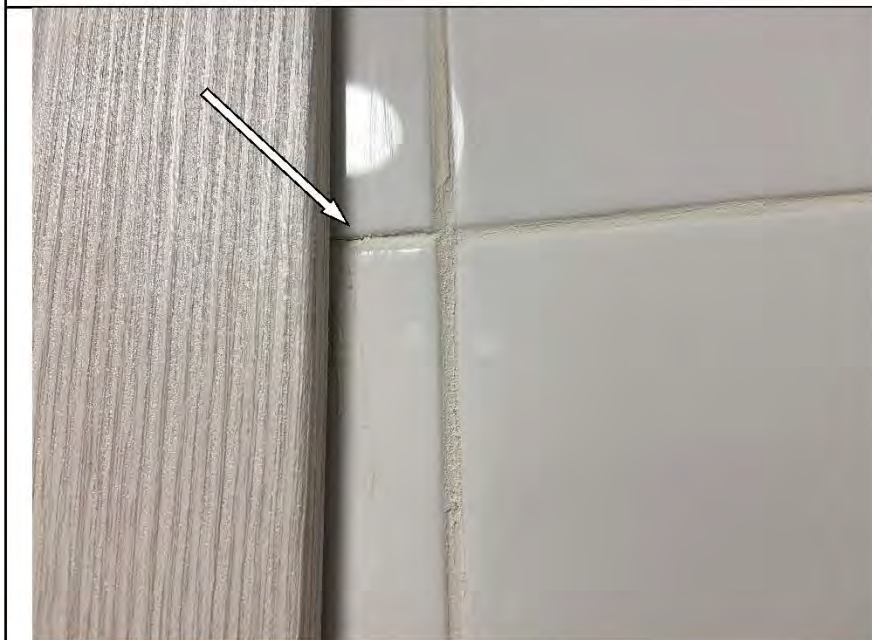
Фото №17. Загрязнения на настенной керамической плитке в санузле.
