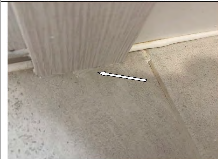
Фото №30. Загрязнения на напольной керамической плитке в ванной комнате.
