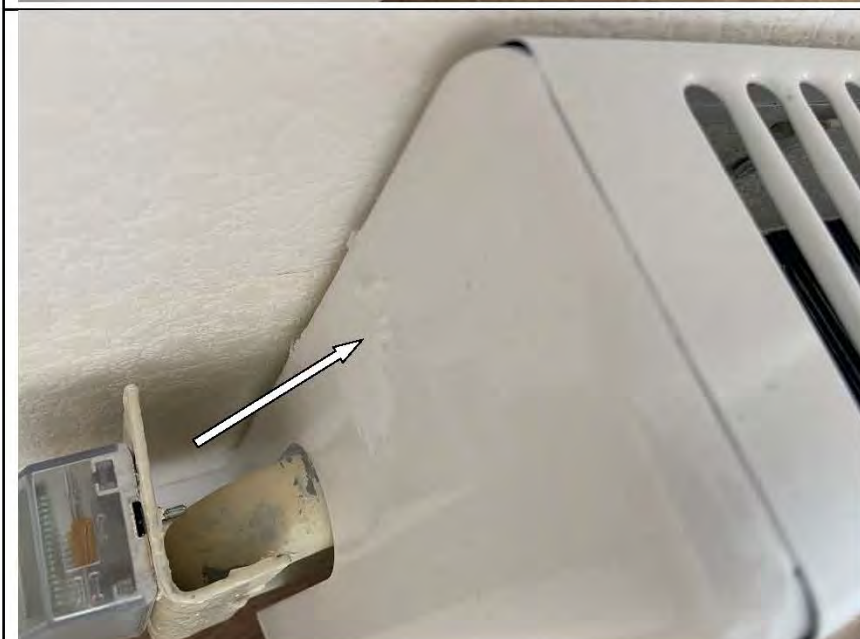
Фото №90. Дефект на металлическом кожухе отопительного прибора в кабинете.
