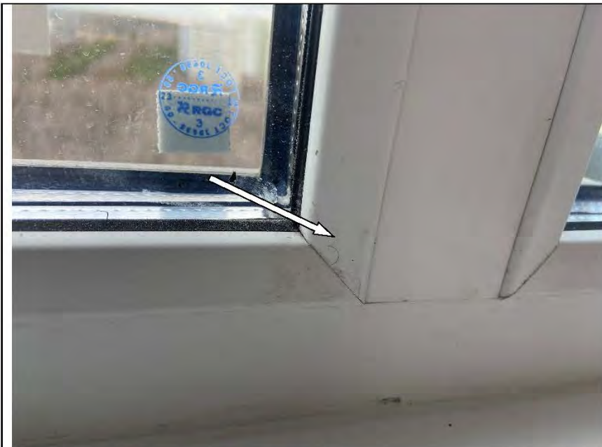
Фото №52. Загрязнения на профиле оконного блока ПВХ в кабинете.
