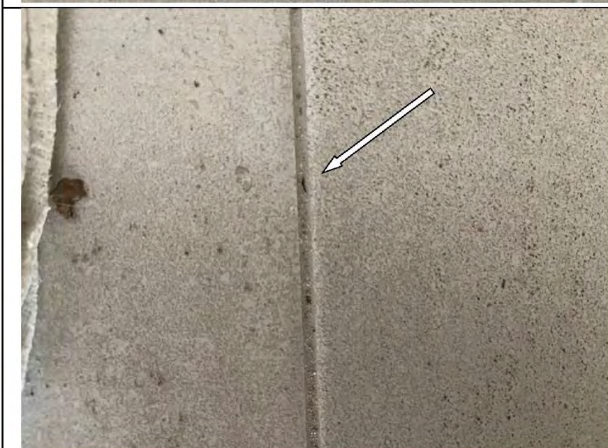
Фото №32. Неровные швы напольной керамической плитки в прихожей.
