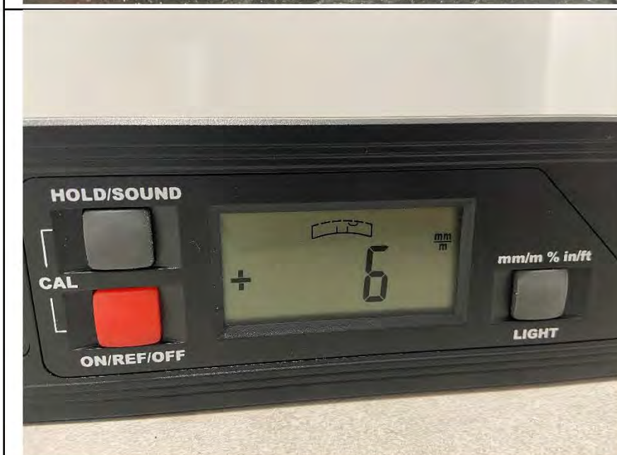
Фото №26. Отклонения напольного покрытия из керамической плитки в санузле.
