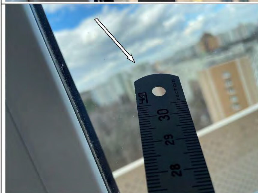
Фото №56. Царапина на стеклопакете оконного блока ПВХ в кабинете.
