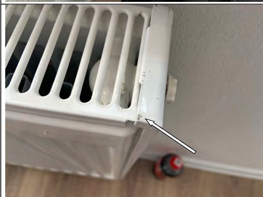
Фото №87. Загрязнения на кожухе отопительного прибора в спальне.
