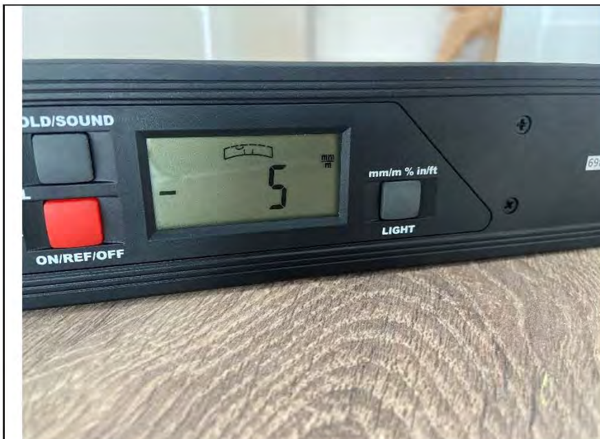
Фото №22. Отклонения напольного покрытия из ламината в кухне.
