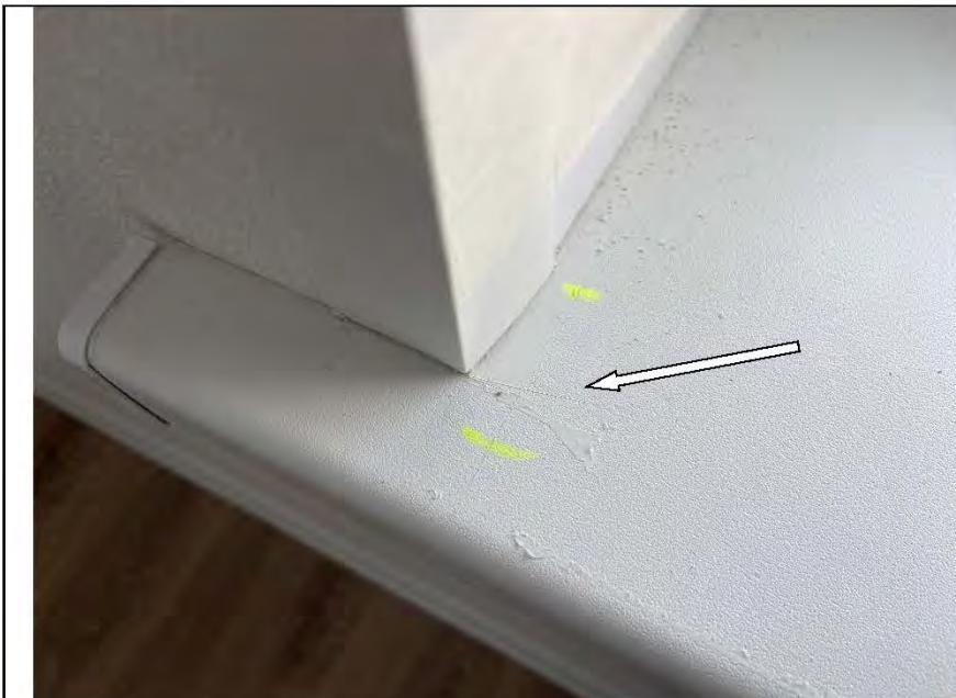
Фото №40. Царапина на лицевой стороне подоконной доски в кабинете.
