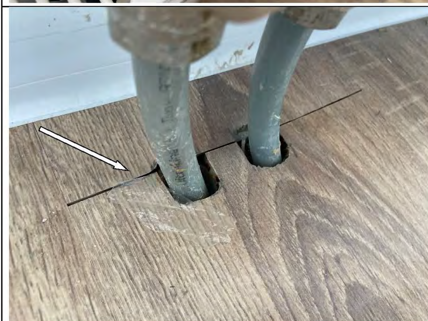
Фото №89. Дефект вставки труб отопления в напольное покрытие из ламината в спальне.
