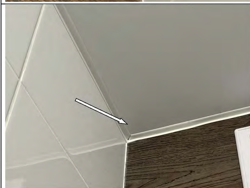
Фото №84. Загрязнения на полотне натяжного потолка в санузле.
