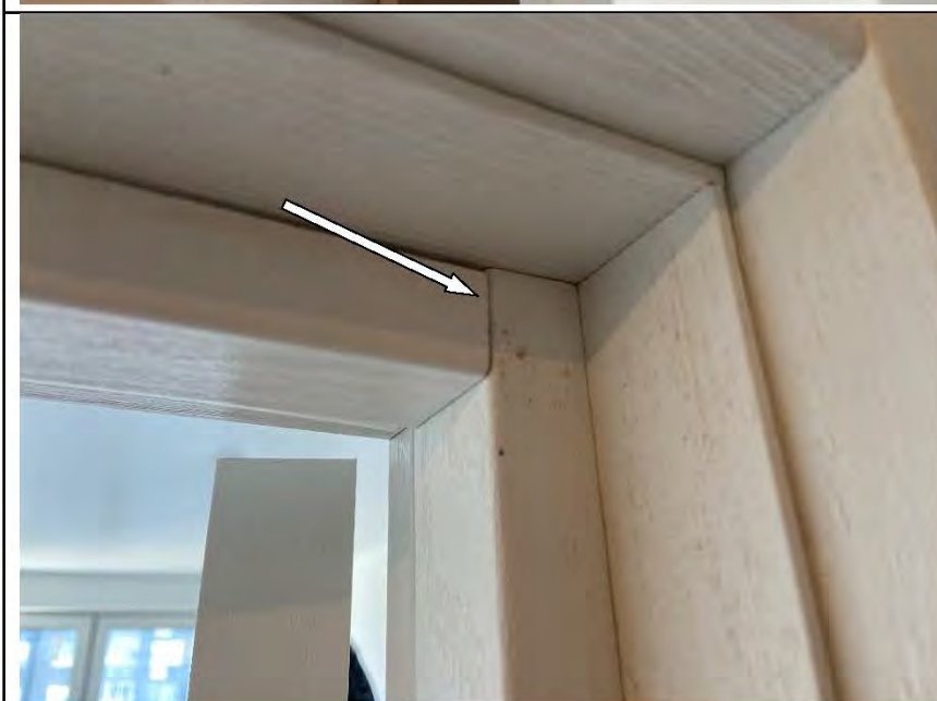
Фото №72. Загрязнения на коробке деревянного дверного блока в спальне.
