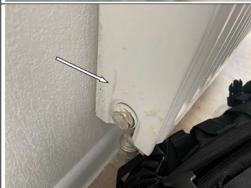
Фото №86. Загрязнения на кожухе отопительного прибора в кухне.
