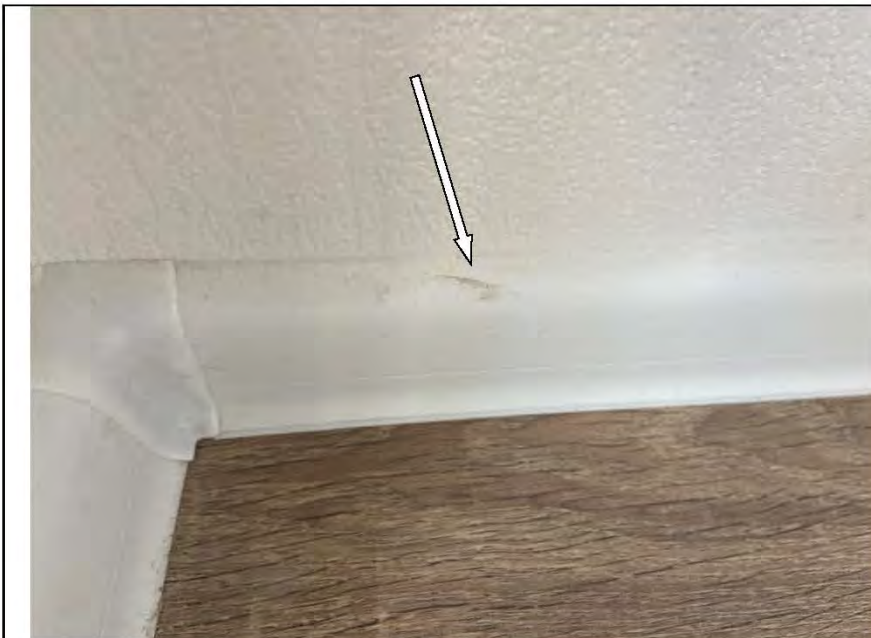
Фото №34. Дефект на напольном плинтусе ПВХ в кабинете.
