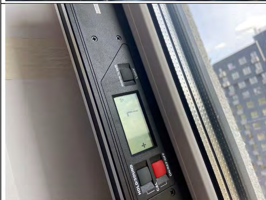
Фото №53. Отклонения по уровню вертикальности оконного блока ПВХ в спальне.
