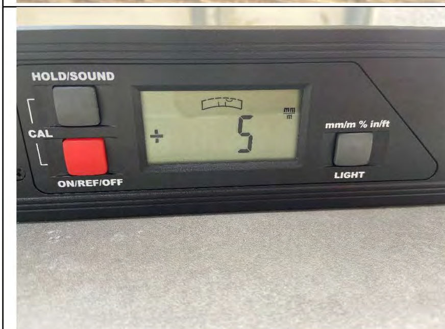
Фото №20. Отклонения напольного покрытия из керамической плитки на лоджии.
