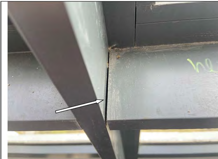
Фото №43. Зазоры на алюминиевом профиле оконного блока на лоджии.
