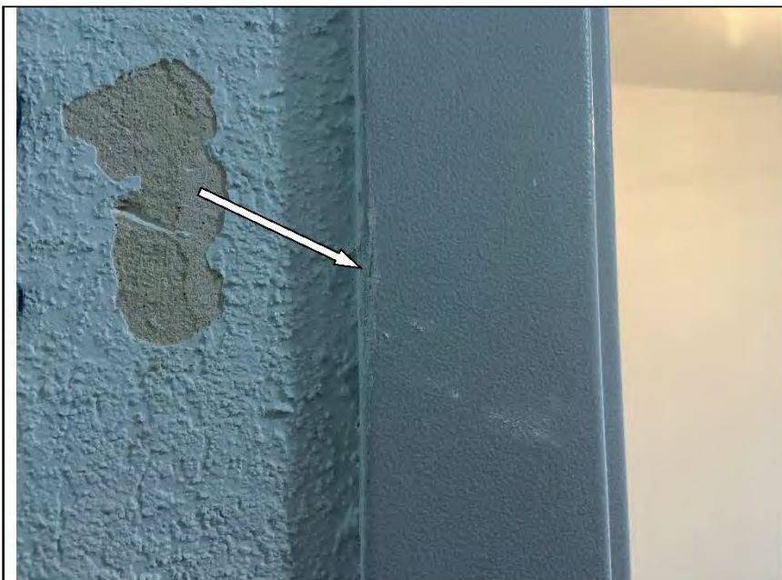
Фото №70. Дефект на наличнике входного дверного блока в коридоре.
