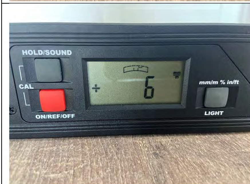
Фото №24. Отклонения напольного покрытия из ламината в кабинете.
