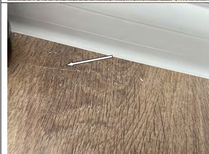
Фото №38. Дефект на напольном покрытии из ламината в спальне.
