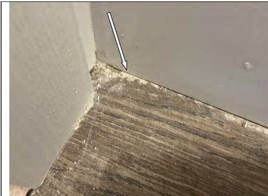
Фото №25. Загрязнения на напольной керамической плитке в ванной комнате.
