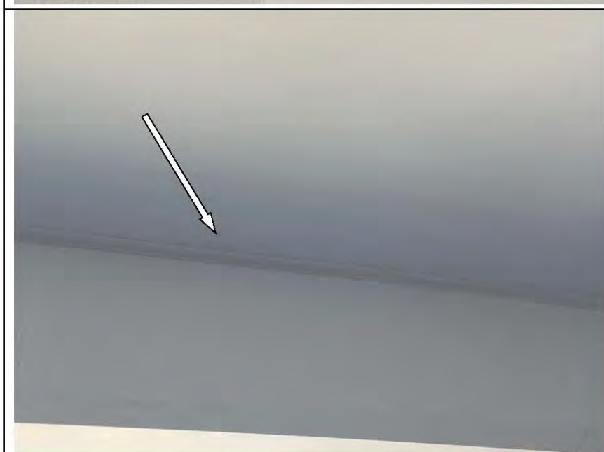
Фото №81. Загрязнения на полотне натяжного потолка в кабинете.
