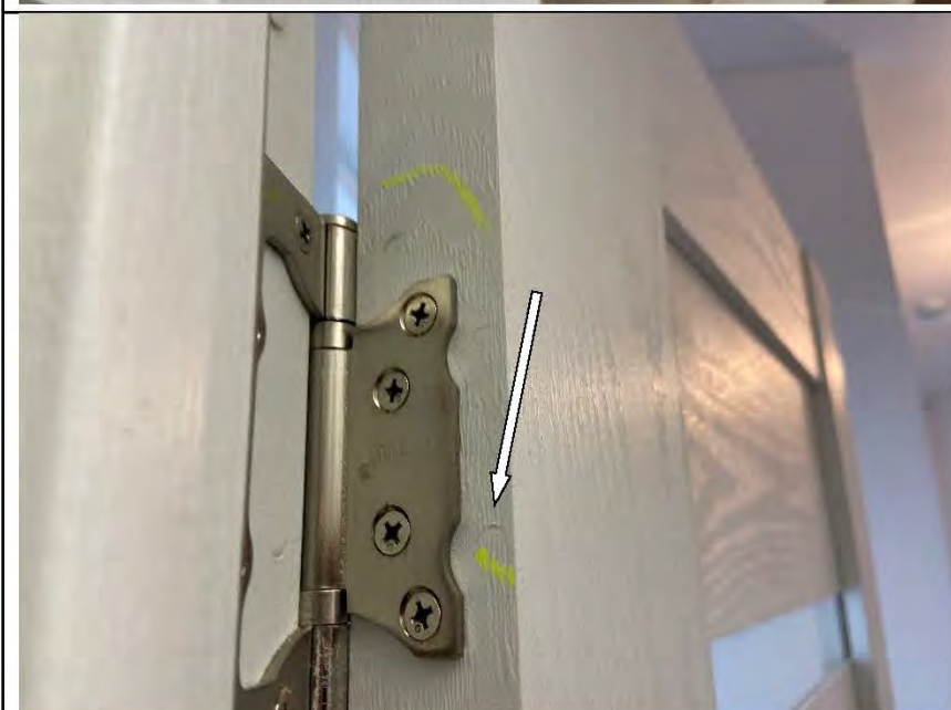
Фото №62. Загрязнения на полотне деревянного дверного блока в ванной комнате.
