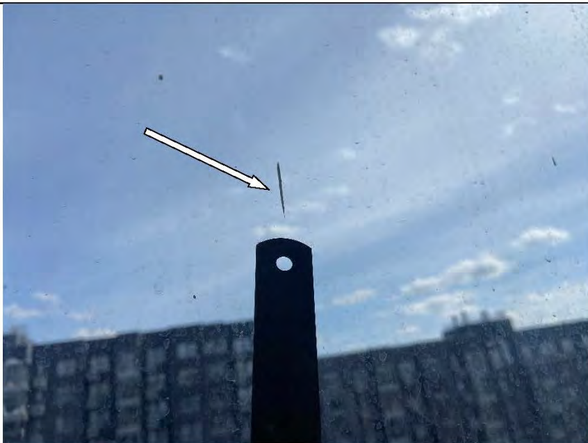
Фото №51. Дефект на стеклопакете оконного блока на лоджии.
