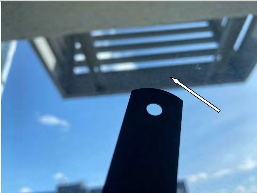
Фото №50. Царапина на стеклопакете оконного блока ПВХ в кабинете.
