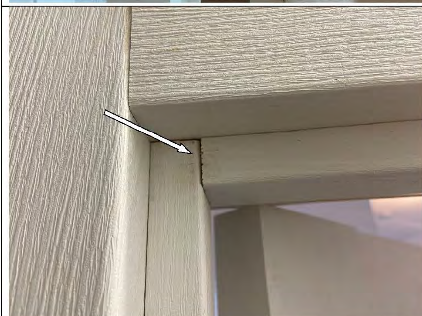
Фото №74. Сколы на коробке деревянного дверного блока в ванной комнате.
