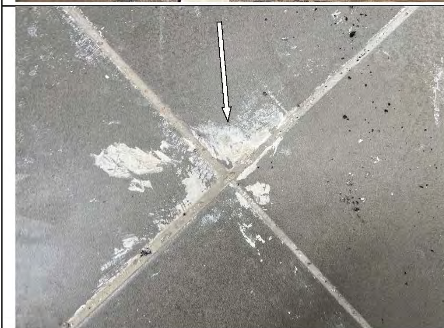
Фото №27. Загрязнения на напольной керамической плитке на лоджии.
