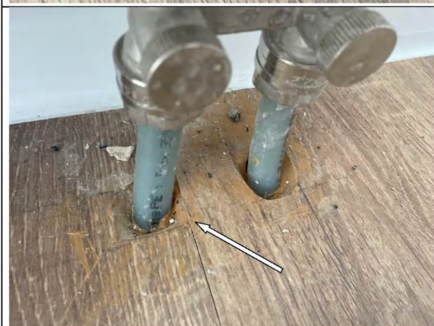
Фото №90. Дефект вставки труб отопления в напольное покрытие из ламината в кабинете.
