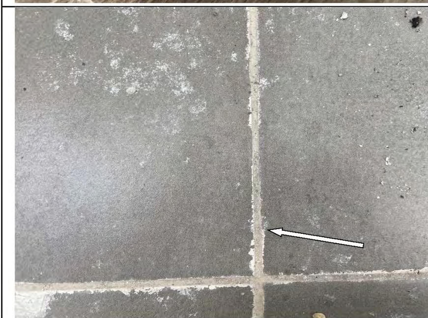
Фото №30. Неровные швы напольной керамической плитки на лоджии.
