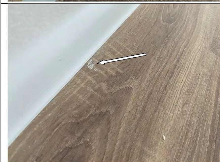
Фото №36. Дефект на напольном покрытии из ламината в кухне.
