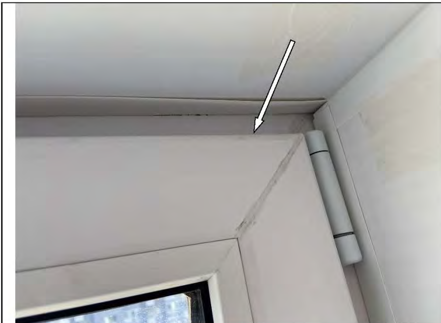
Фото №46. Загрязнения на профиле оконного блока ПВХ в спальне.
