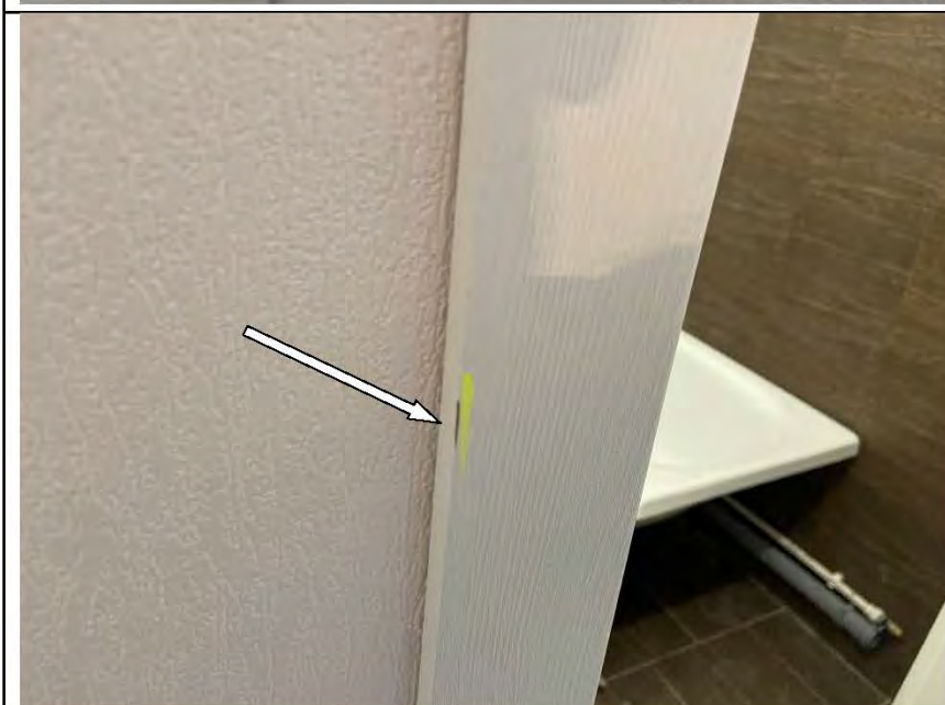
Фото №68. Дефект на наличнике деревянного дверного блока в ванной комнате.
