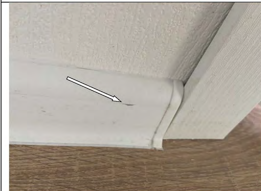
Фото №32. Дефект на напольном плинтусе ПВХ в кухне.
