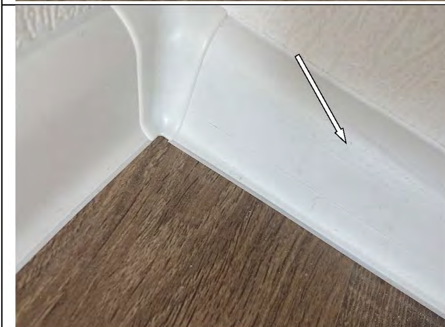
Фото №33. Дефект на напольном плинтусе ПВХ в спальне.
