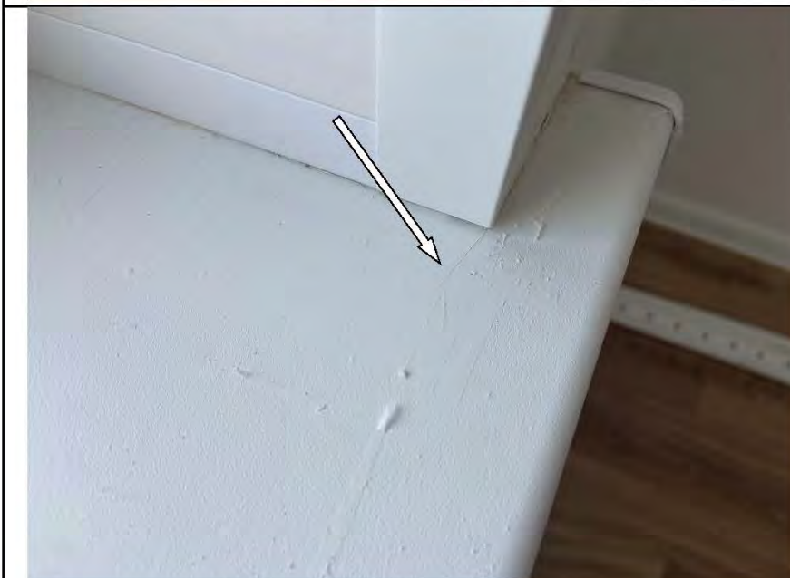
Фото №41. Царапина на лицевой стороне подоконной доски в спальне.
