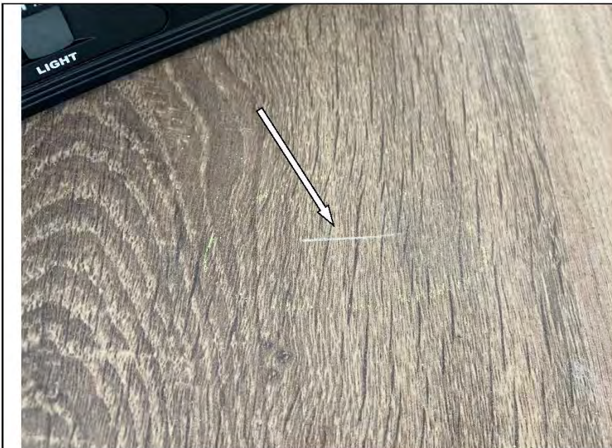
Фото №37. Дефект на напольном покрытии из ламината в кухне.
