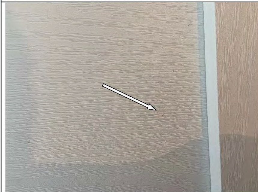
Фото №60. Загрязнения на полотне деревянного дверного блока в спальне.
