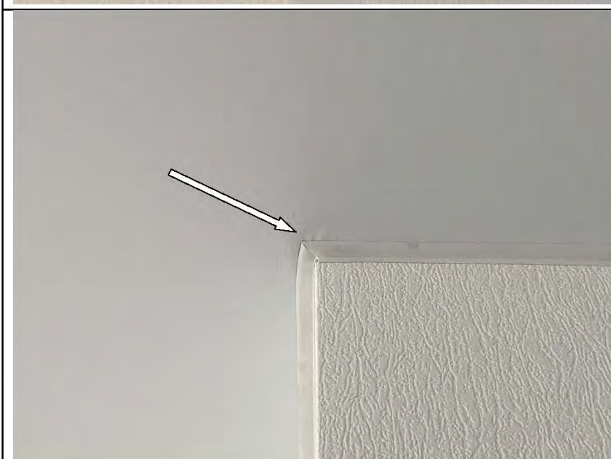
Фото №78. Загрязнения на полотне натяжного потолка в кухне.
