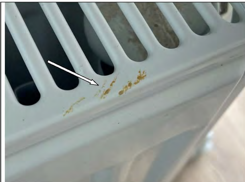
Фото №85. Загрязнения на кожухе отопительного прибора в кухне.
