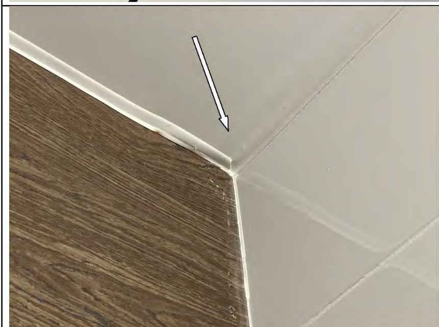
Фото №83. Загрязнения на полотне натяжного потолка в ванной комнате.
