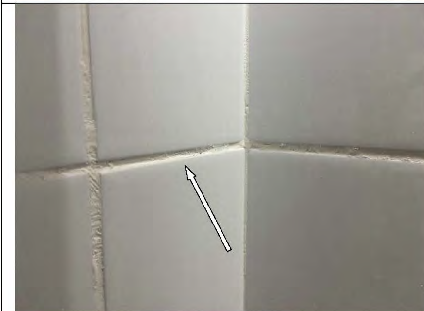
Фото №17. Неровные швы настенной керамической плитки в санузле.
