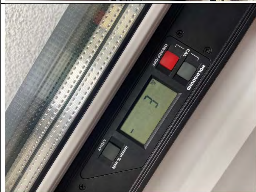
Фото №54. Отклонения по уровню вертикальности оконного блока ПВХ в кабинете.
