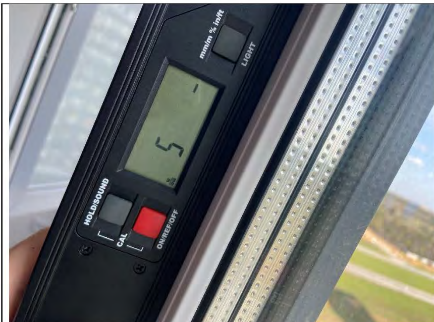
Фото №55. Отклонения по уровню вертикальности оконного блока ПВХ в кухне.
