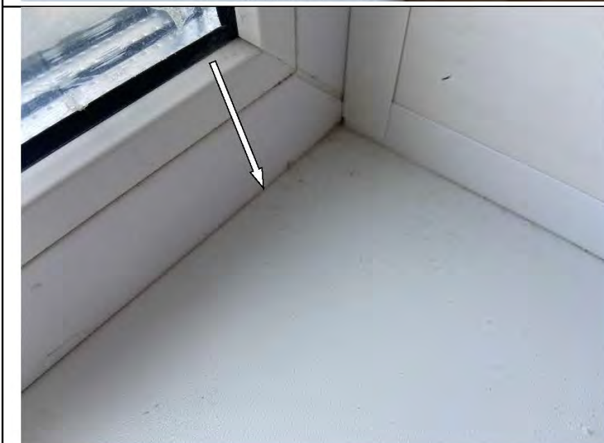
Фото №42. Царапина на лицевой стороне подоконной доски в кухне.
