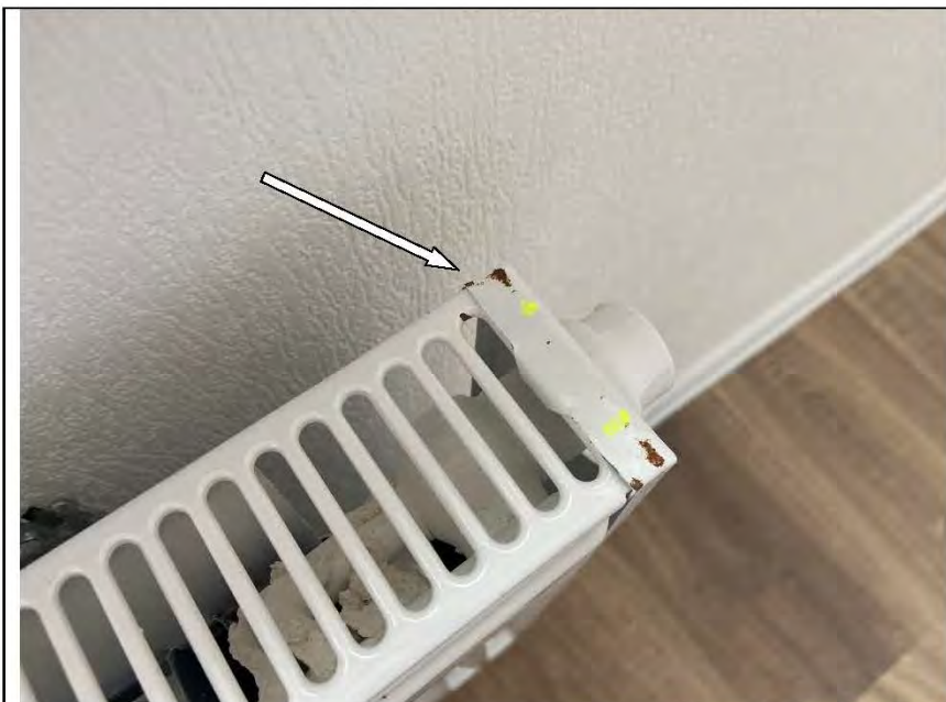
Фото №88. Загрязнения на кожухе отопительного прибора в кабинете.
