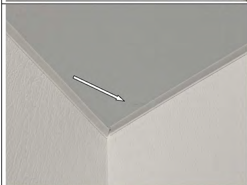
Фото №80. Загрязнения на полотне натяжного потолка в спальне.
