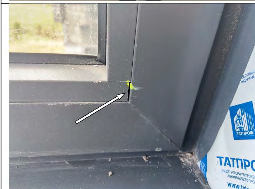
Фото №44. Зазоры на алюминиевом профиле оконного блока на лоджии.
