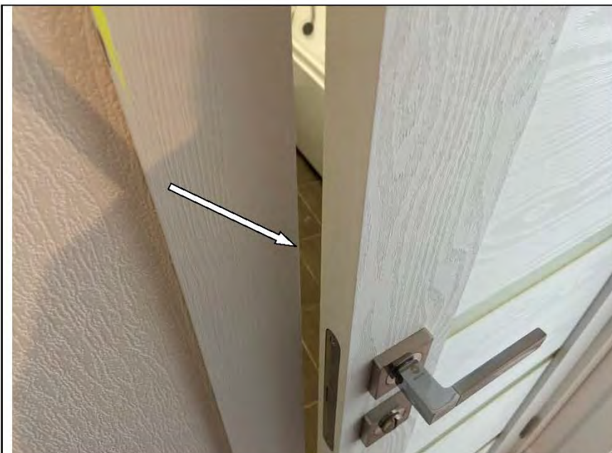
Фото №64. Не закрывается/открывается свободно дверь в ванной комнате.
