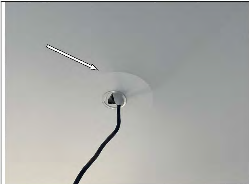
Фото №82. Видны инженерные сети на полотне натяжного потолка в кабинете.
