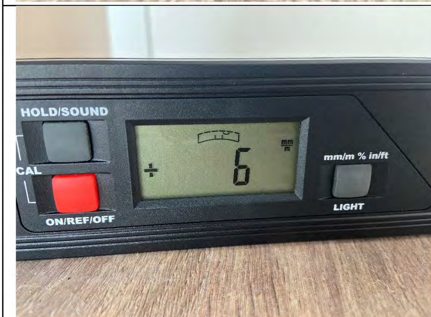
Фото №23. Отклонения напольного покрытия из ламината в спальне.
