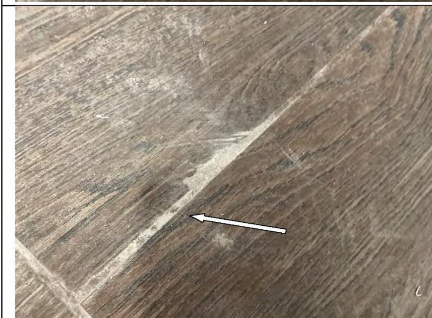
Фото №29. Неровные швы напольной керамической плитки в санузле.
