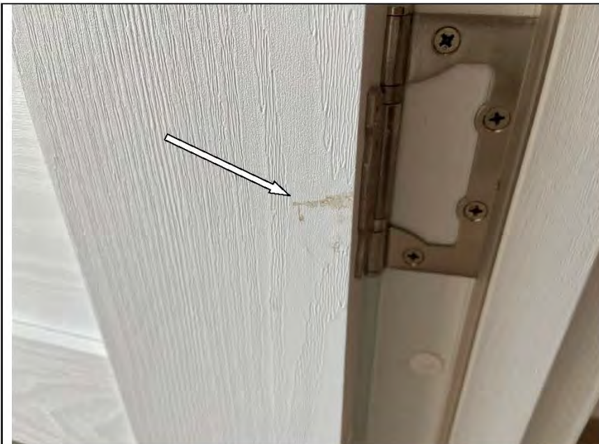
Фото №61. Загрязнения на полотне деревянного дверного блока в кабинете.
