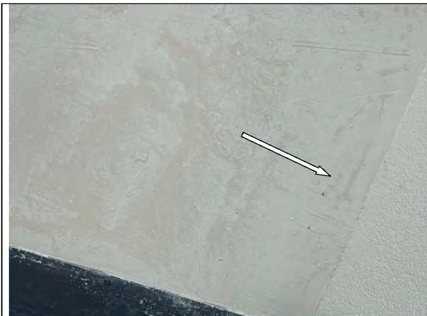
Фото №76. Неровности, выбоины на оштукатуренном потолке на лоджии.
