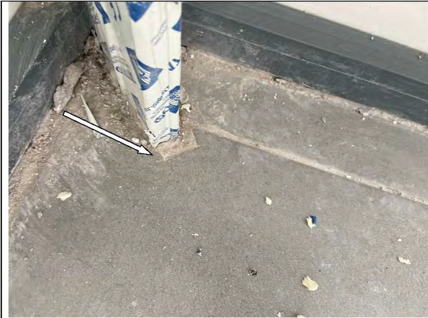
Фото №91. Сколы на напольном покрытии из керамической плитки на лоджии.
