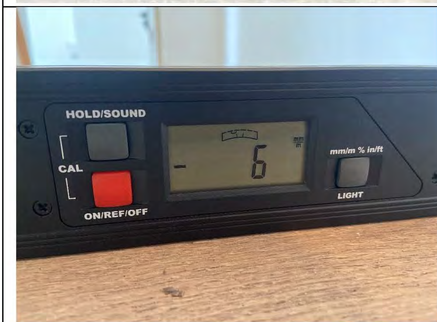
Фото №21. Отклонения напольного покрытия из ламината в коридоре.
