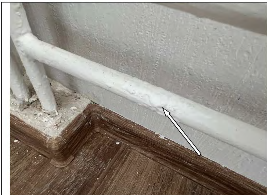
Фото №34. Подтеки краски на трубах отопления в кухне- гостиной.
