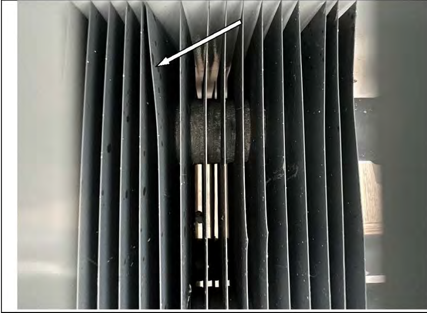
Фото №37. Замятие сот радиатора в кухне-гостиной.
