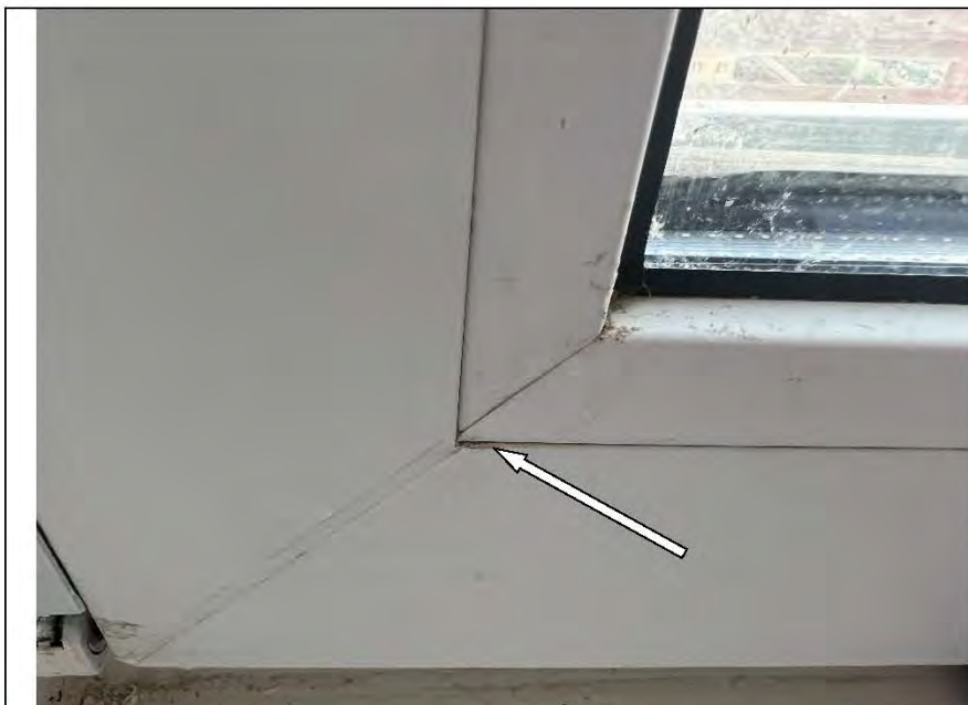
Фото №22. Зазоры в стыках профилей оконного блока ПВХ в кухне-гостиной.
