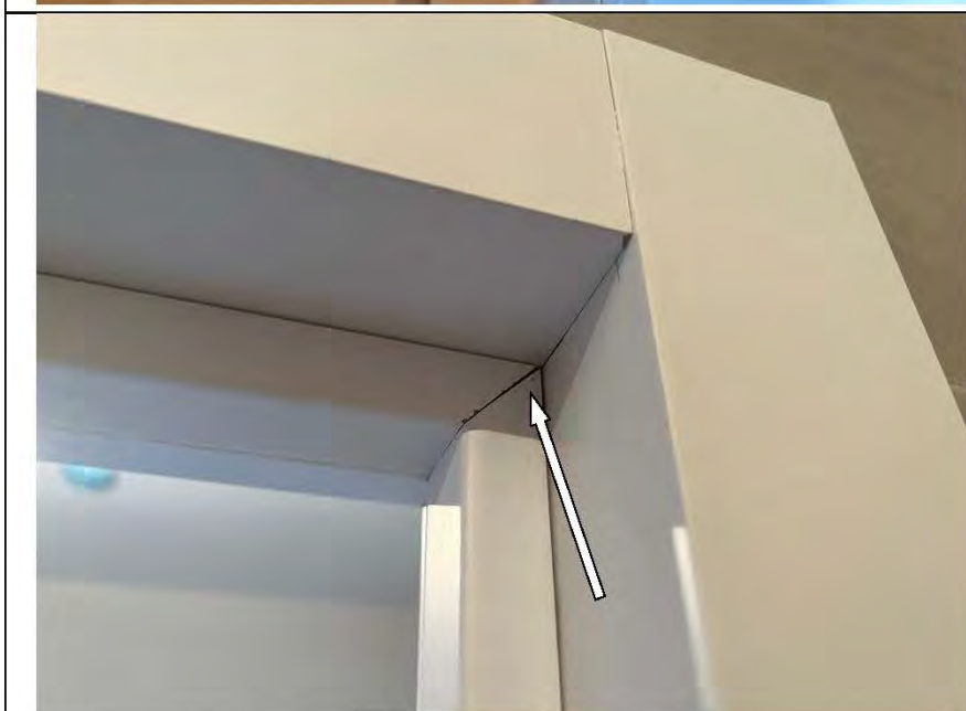
Фото №30. Элементы дверного блока соединены не надежно в ванной комнате (коробка).
