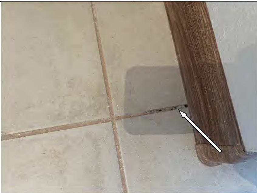
Фото №15. Пропуски затирочного раствора в швах напольной керамической плитки в коридоре.
