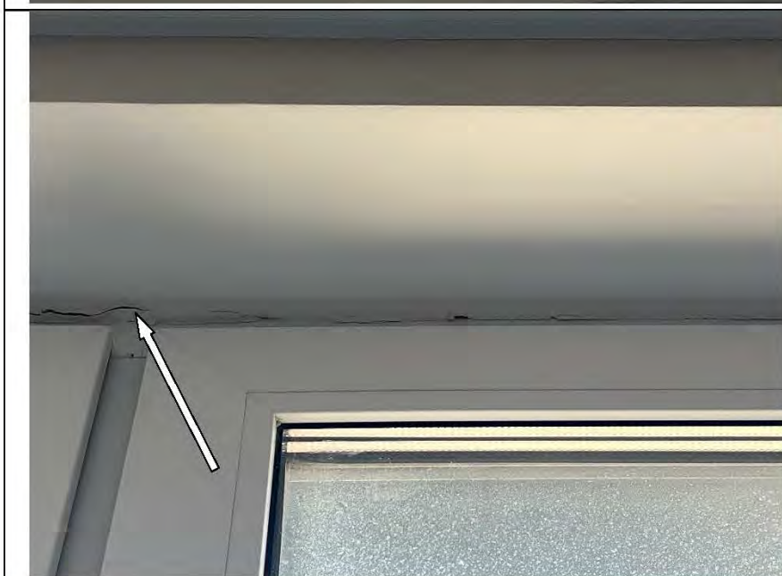
Фото №17. Трещины по отколу оконного блока ПВХ в кухне-гостиной.
