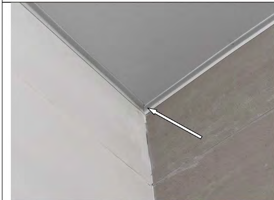
Фото №26. Зазор в стыке декоративного молдинга крепления натяжного потолка в ванной комнате.
