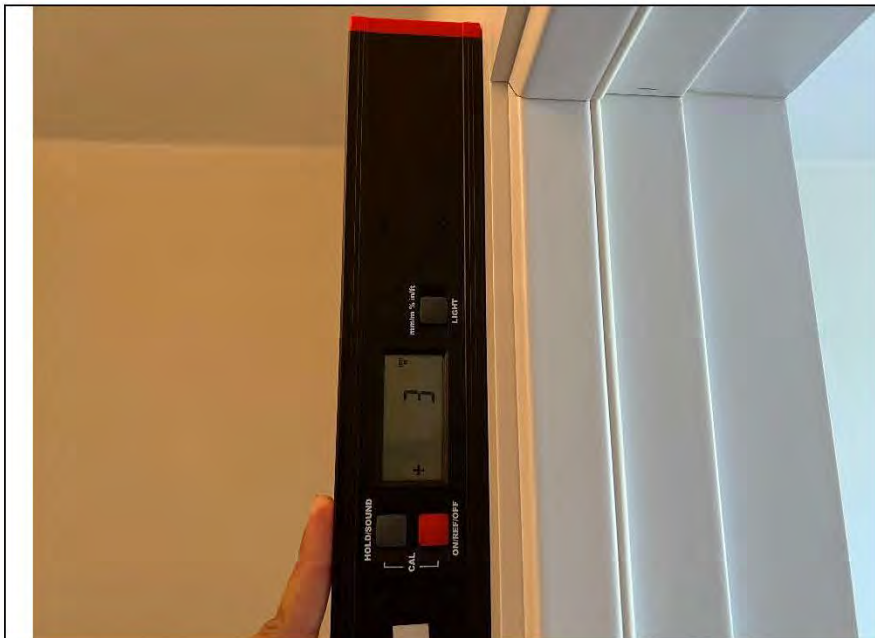
Фото №28. Отклонение наличников дверного блока в кухне- гостиной равно 3 мм.
