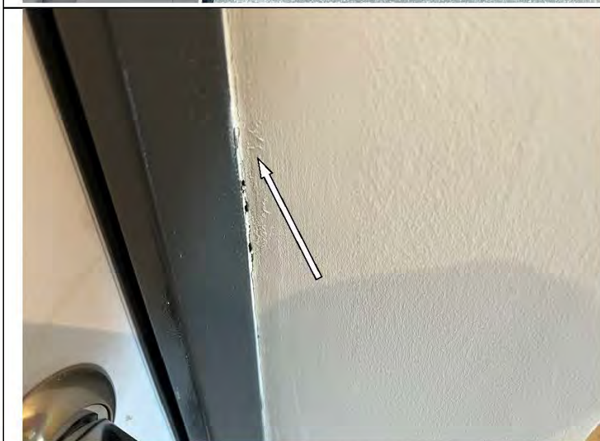
Фото №18. Подтеки краски на отколу входного дверного блока.
