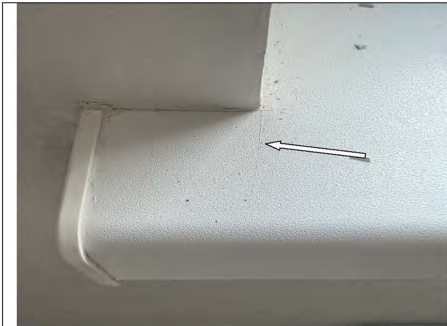
Фото №16. Царапины на лицевой поверхности подоконной доски в кухне-гостиной.
