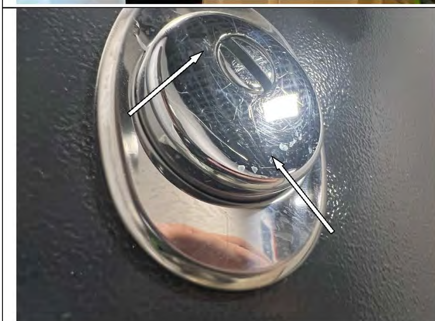
Фото №33. Царапины на замке входного дверного блока.
