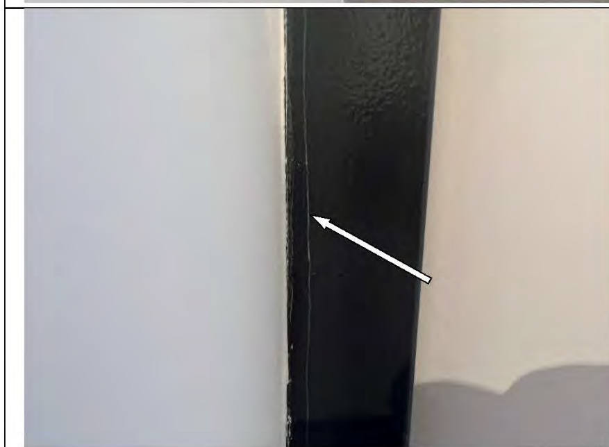
Фото №27. Царапина на коробке входного дверного блока.
