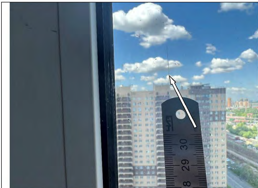
Фото №19. Царапины на стеклопакете оконного блока ПВХ в кухне-гостиной.
