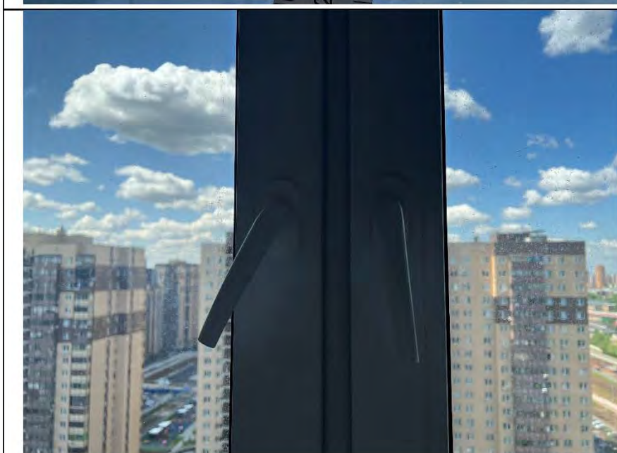
Фото №21. Не отрегулирована фурнитура оконного блока ПВХ в кухне-гостиной.
