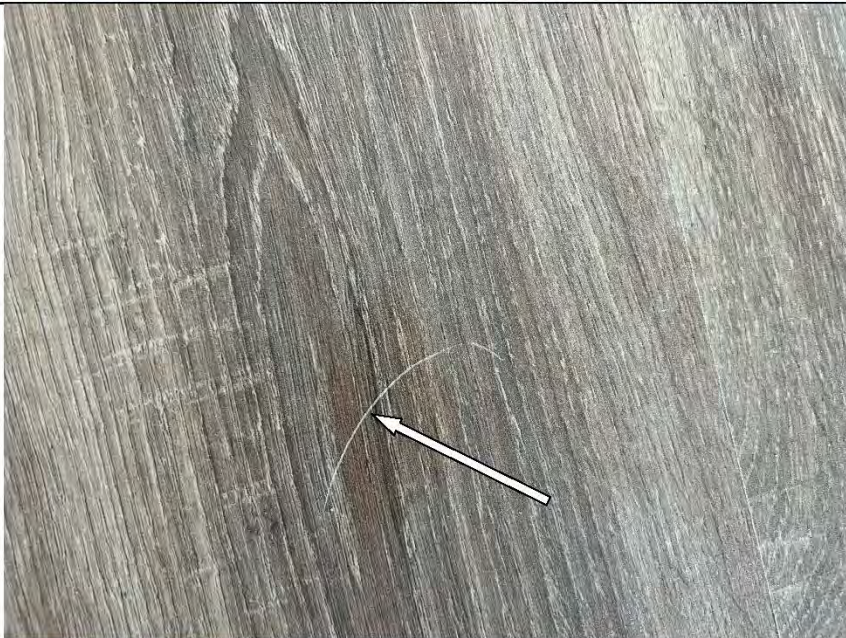
Фото №14. Механическое повреждение лицевой поверхности ламината в кухне-гостиной.
