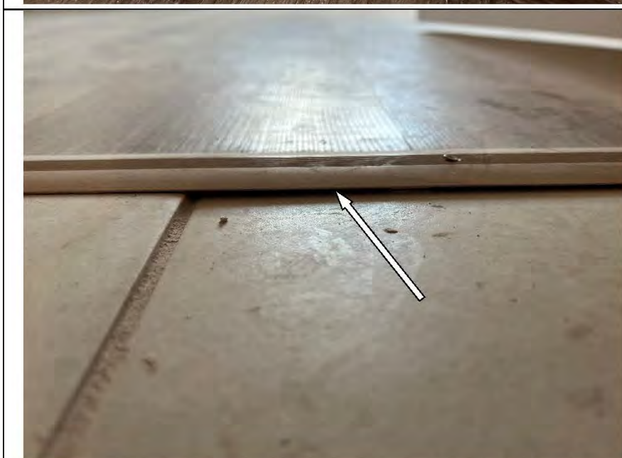
Фото №35. Зазор в стыке металлического порога и напольной керамической плитки в кухне-гостиной.
