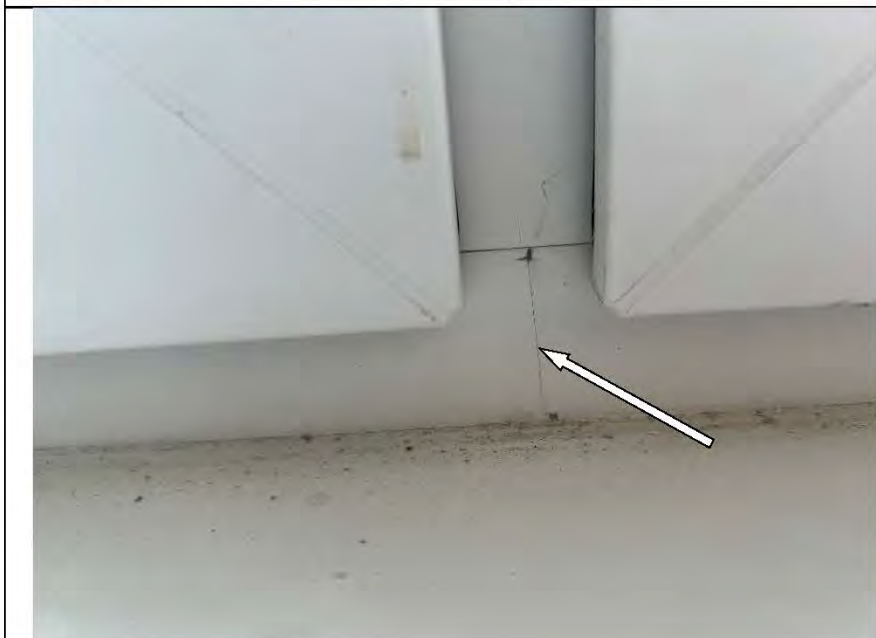
Фото №23. Царапина на раме оконного блока ПВХ в кухне-гостиной.
