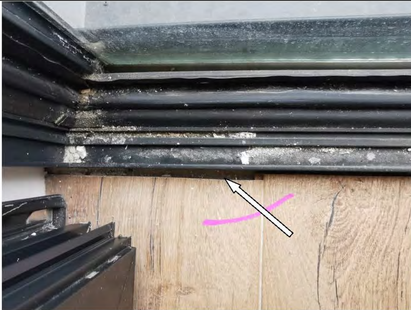
Фото №28. Коротко подрезан ламинат на стыке элементов в кухне.
