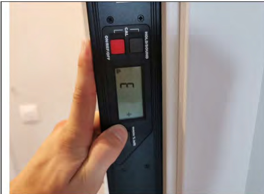
Фото №67. Отклонение коробки деревянного дверного блока от уровня вертикальности в детской.
