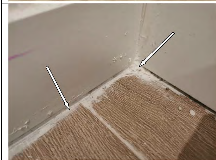
Фото №36. Загрязнение затирочным раствором напольной керамической плитки в санузле.
