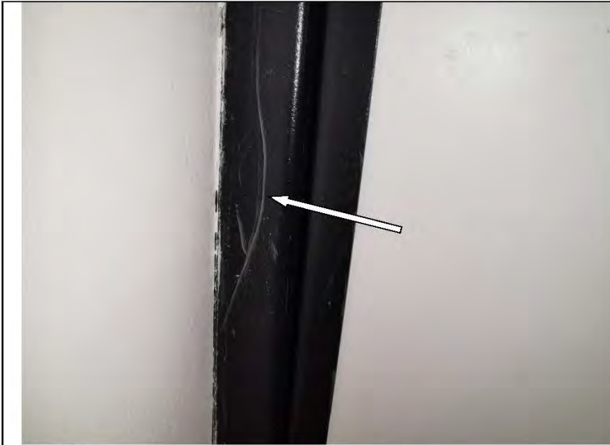
Фото №79. Царапины на коробке входного дверного блока.
