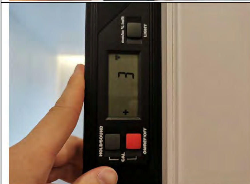
Фото №68. Отклонение коробки деревянного дверного блока от уровня вертикальности в спальне.
