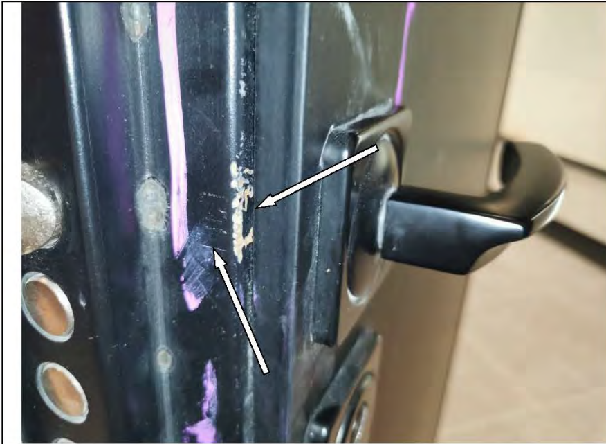
Фото №82. Замытия и потертости на коробке входного дверного блока.
