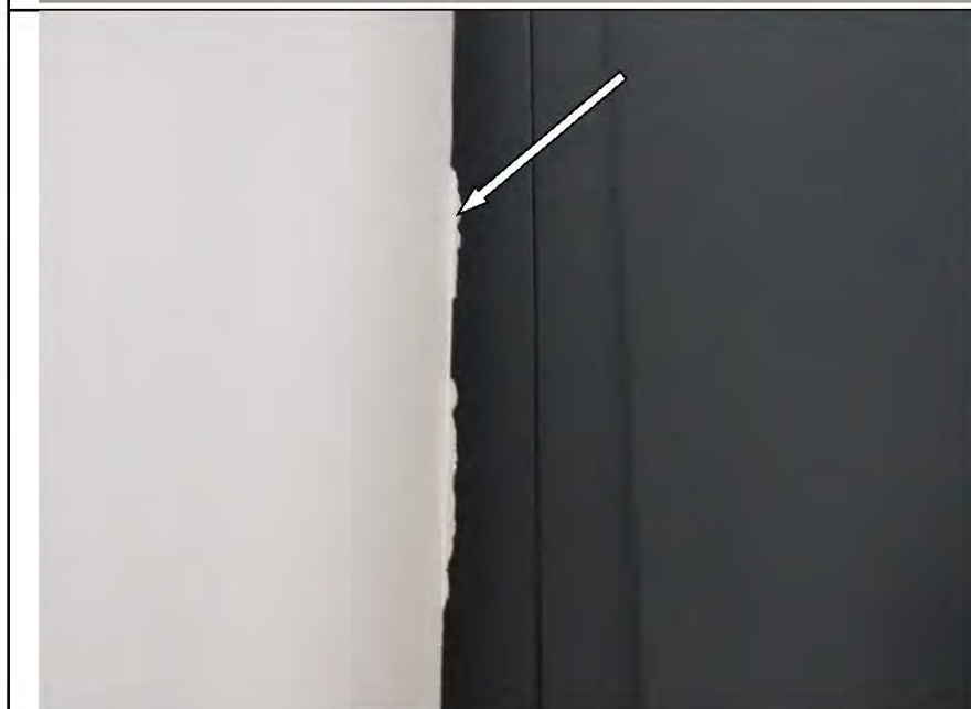
Фото №51. Загрязнение профиля металлического оконного блока в детской.
