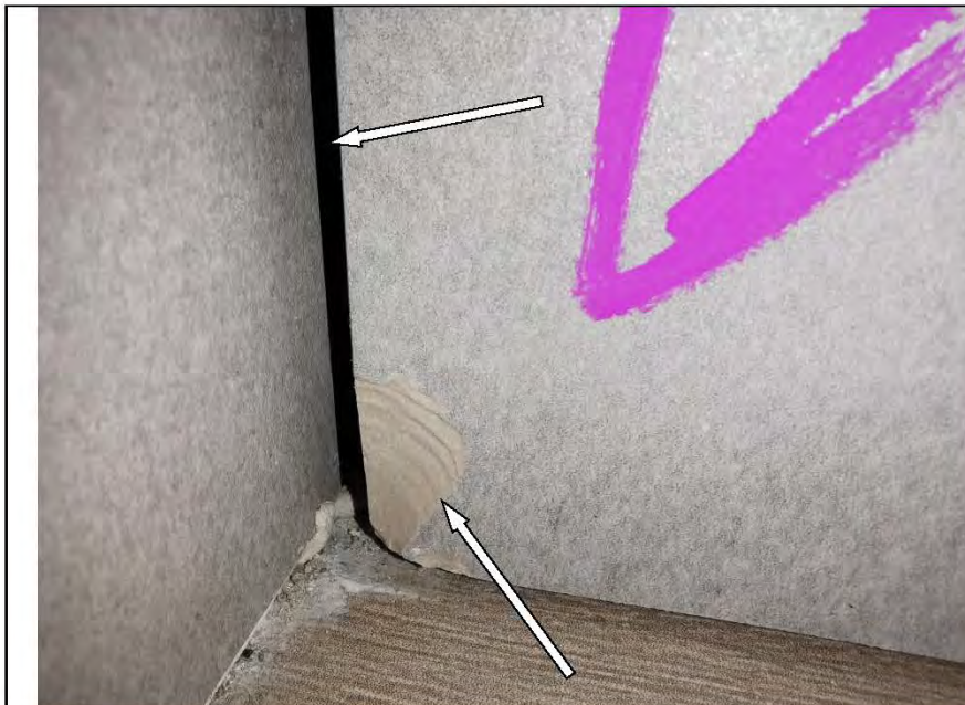
Фото №22. Отбитости настенной керамической плитки, неполное заполнение шовного пространства настенной керамической плитки затирочным составом в ванной комнате.
