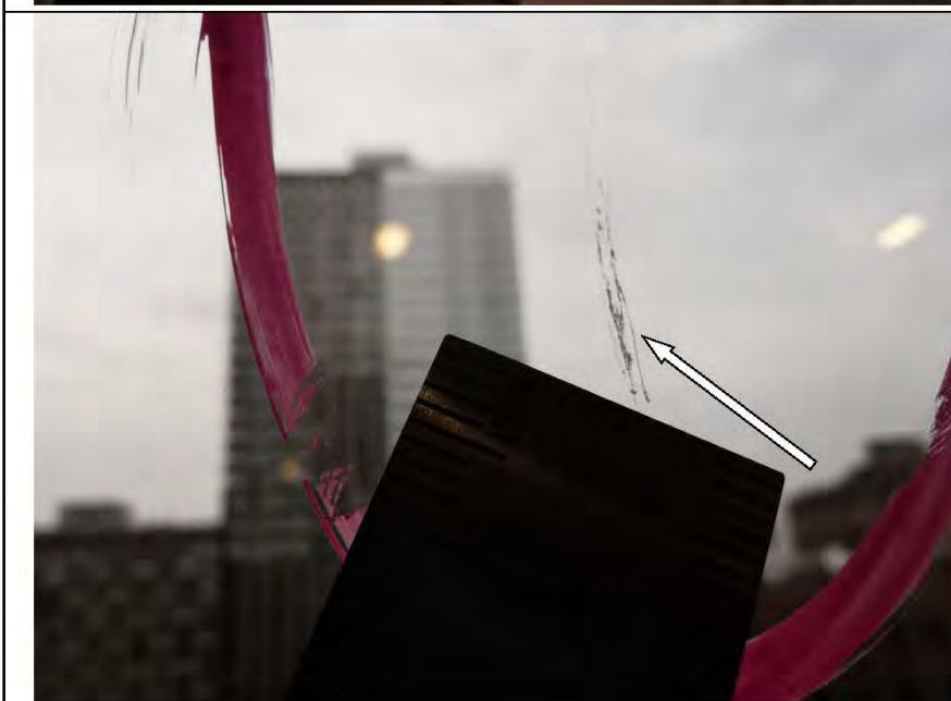
Фото №60. Царапины на стеклопакете металлического оконного блока в кухне.
