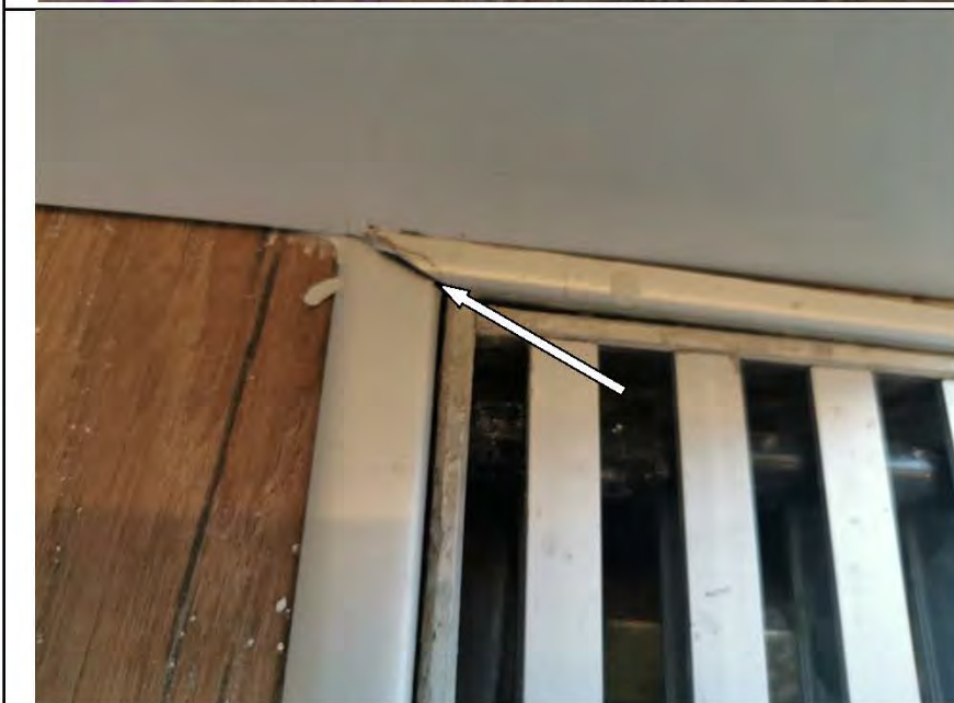
Фото №41. Некачественная укладка металлического порожка в кухне.
