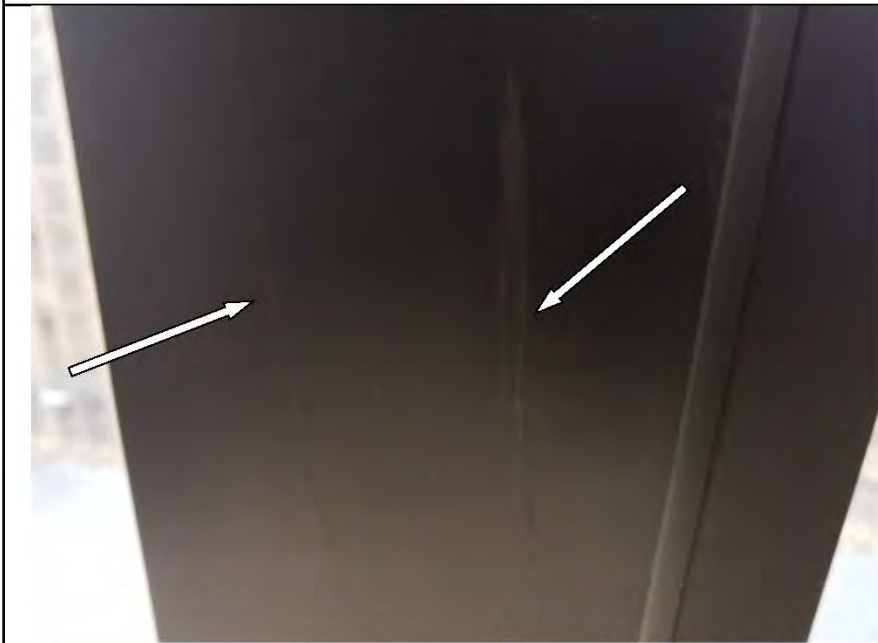
Фото №53. Царапины на профиле металлического оконного блока в кухне.
