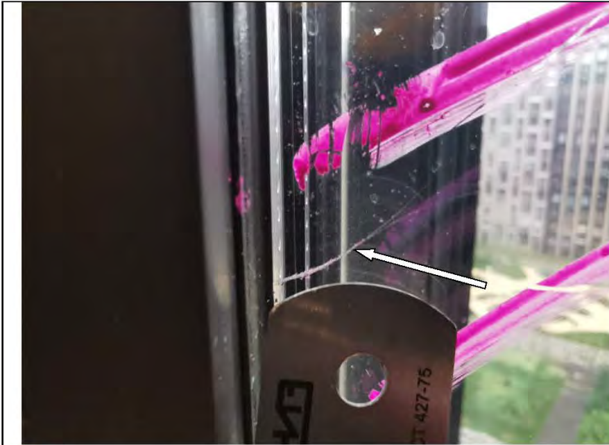
Фото №61. Царапины на стеклопакете металлического оконного блока в кухне.
