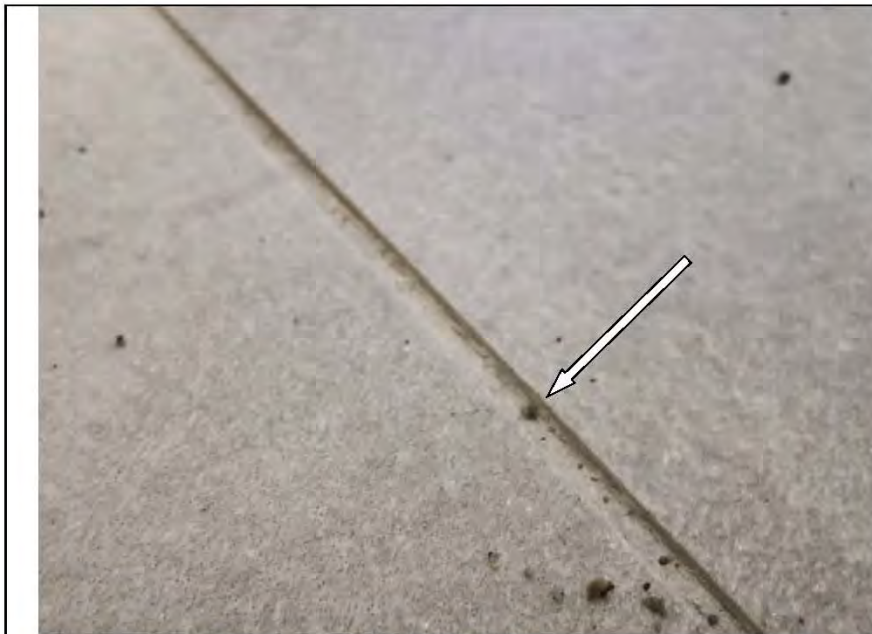
Фото №34. Неполное заполнение шовного пространства затирочным составом в коридоре.
