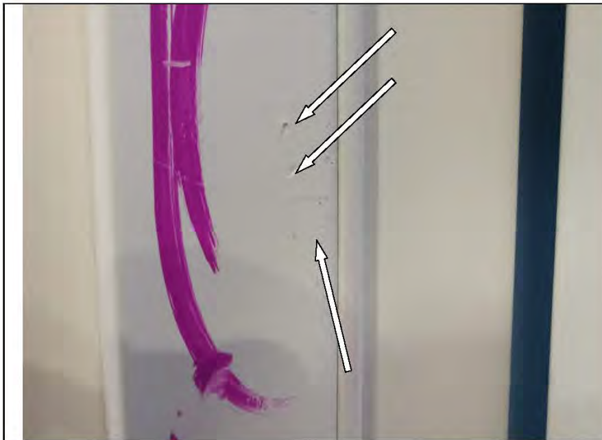
Фото №73. Потертости и вмятины на коробе деревянного дверного блока в спальне.
