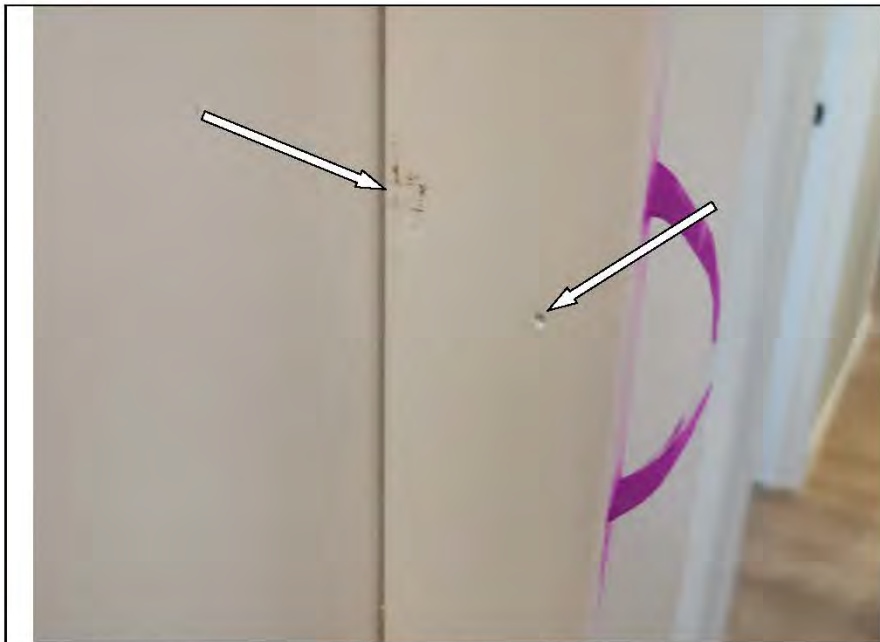
Фото №70. Вмятины и загрязнения на коробе деревянного дверного блока в ванной комнате.
