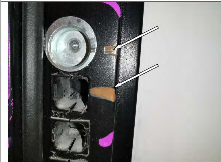
Фото №80. Потертости на коробке входного дверного блока.
