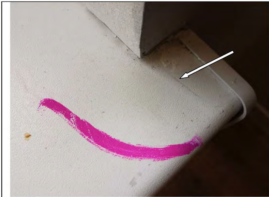
Фото №64. Царапины на лицевой поверхности подоконной доски в спальне.
