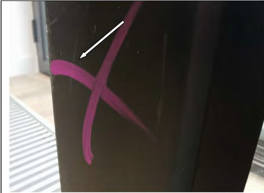
Фото №52. Царапины на профиле металлического оконного блока в кухне.
