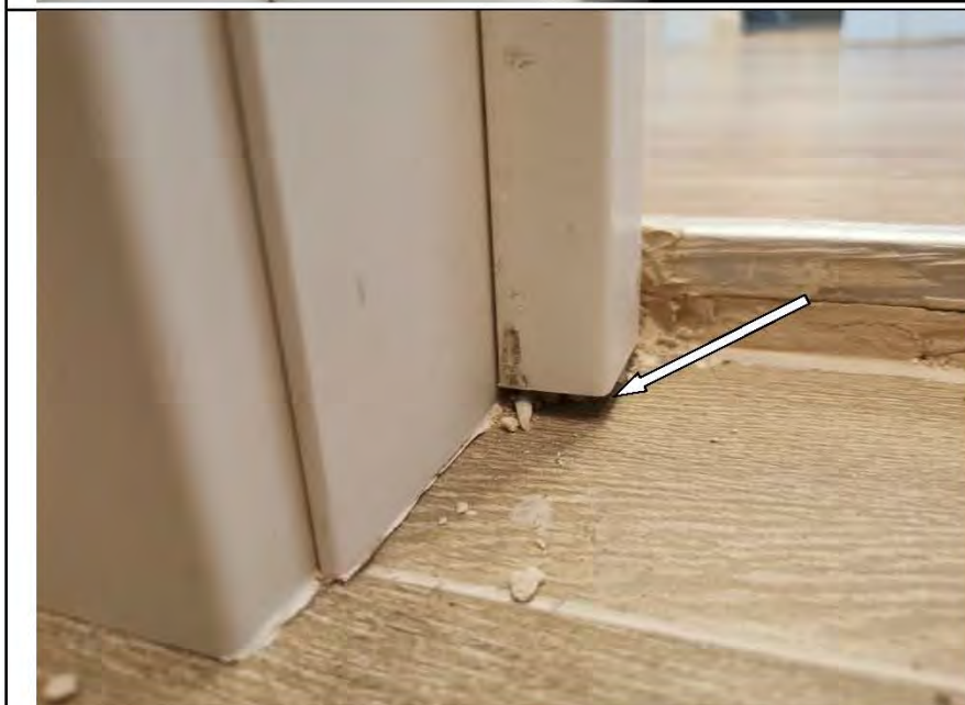
Фото №77. Коротко подрезан короб деревянного дверного блока в ванной комнате.
