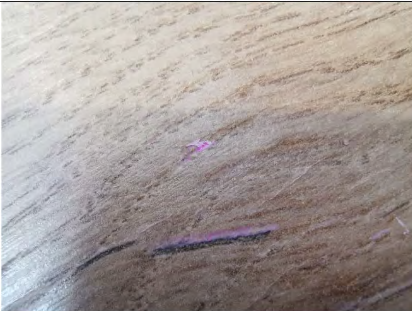
Фото №29. Потертости на напольном покрытии, выполненном из досок ламината, в спальне.
