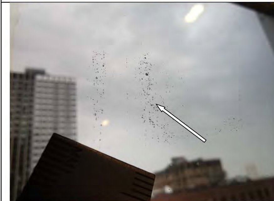
Фото №59. Окалины на стеклопакете металлического оконного блока в спальне.
