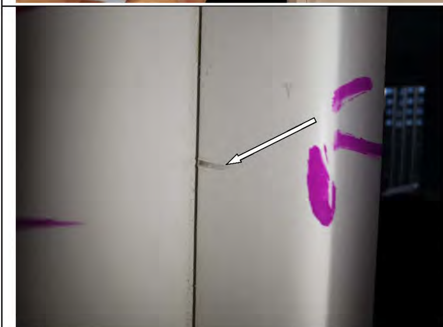
Фото №69. Царапины на коробе деревянного дверного блока в санузле.
