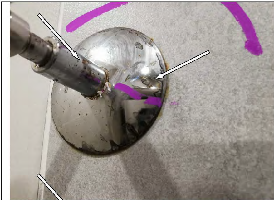
Фото №88. Следы коррозии на полотенцесушителе в ванной комнате.
