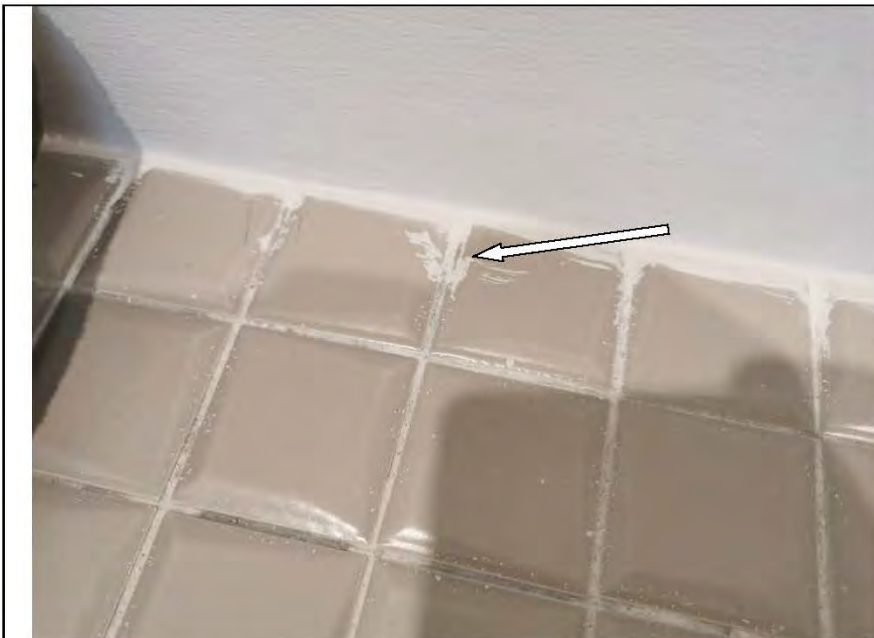
Фото №19. Загрязнение настенной плитки в санузле.
