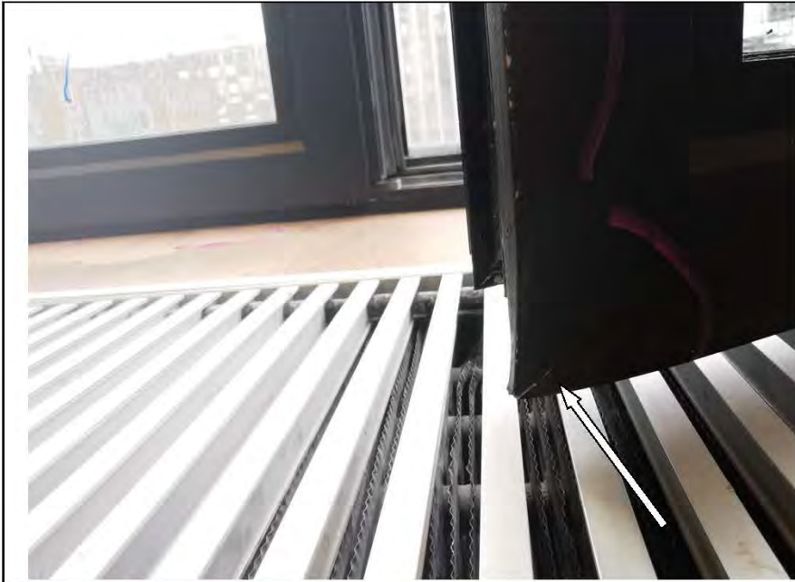
Фото №55. Погнут профиль металлического оконного блока в кухне.
