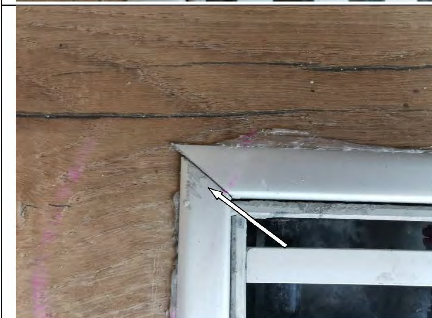
Фото №42. Некачественная укладка металлического порожка в кухне. Потертости на металлическом порожке.
