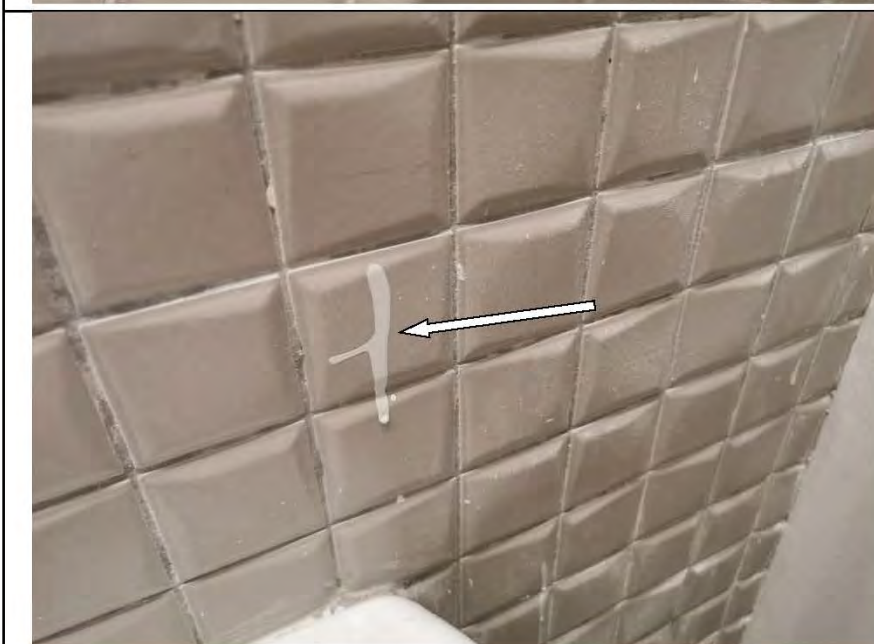
Фото №20. Загрязнение настенной плитки в санузле.
