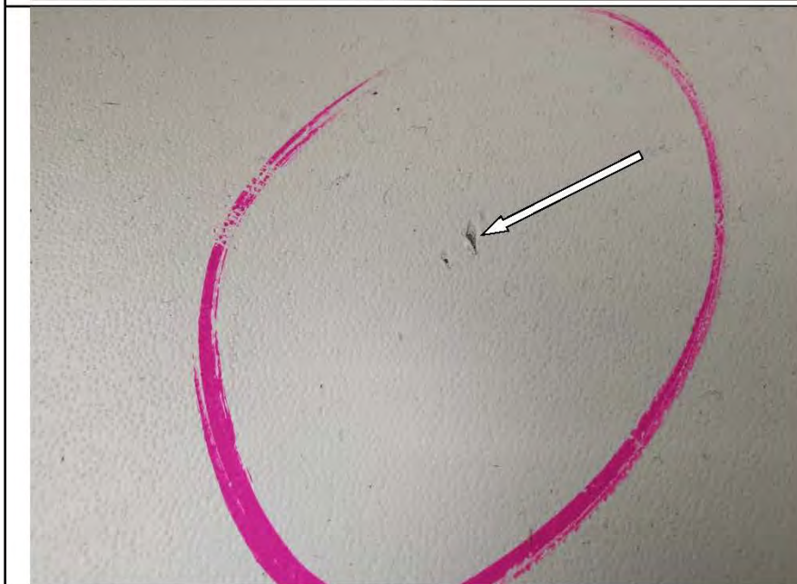
Фото №65. Потертости на лицевой поверхности подоконной доски в спальне.
