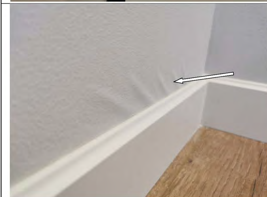
Фото №15. Воздушные пузыри на обойном полотне в спальне.
