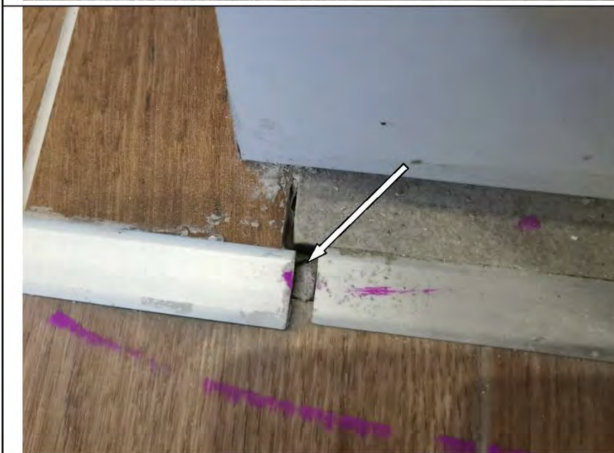
Фото №39. Металлический порожек не обеспечивает полное закрытие стыкового шва в коридоре.
