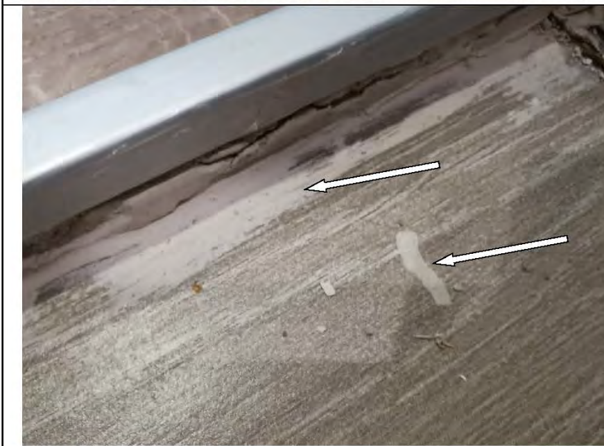
Фото №38. Загрязнение затирочным раствором напольной керамической плитки в ванной комнате.
