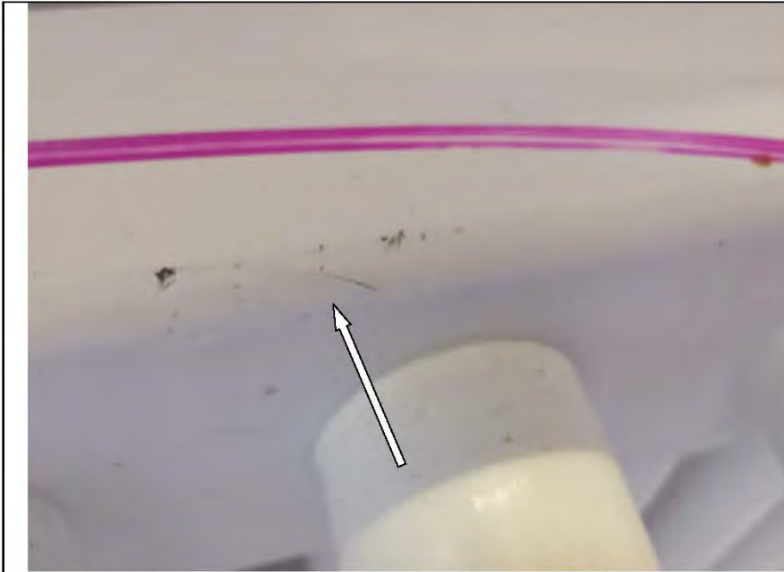
Фото №85. Царапины на радиаторе в спальне.
