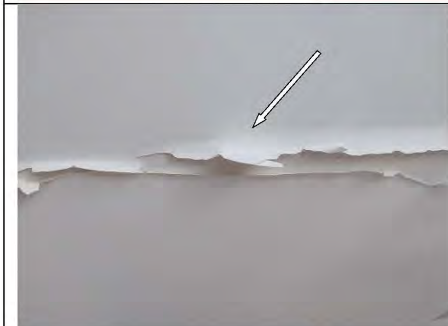
Фото №17. Шпаклеванная и окрашенная поверхность потолка в спальне имеют дефекты, характерные последствиям залива (отслоения).
