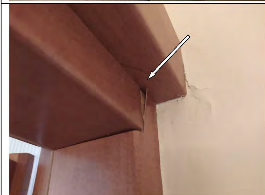
Фото №30. Коробка деревянного дверного блока имеет дефекты (отслоение ламинации от вздутия) в детской, характерное последствиям залива.
