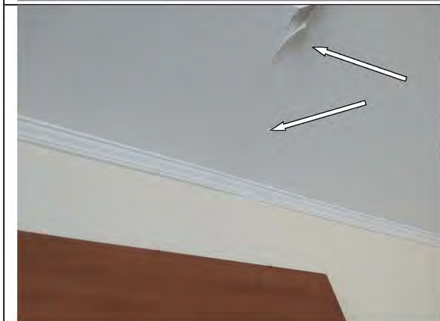
Фото №18. Шпаклеванная и окрашенная поверхность потолка в спальне имеют дефекты, характерные последствиям залива (отслоения, следы заливия).
