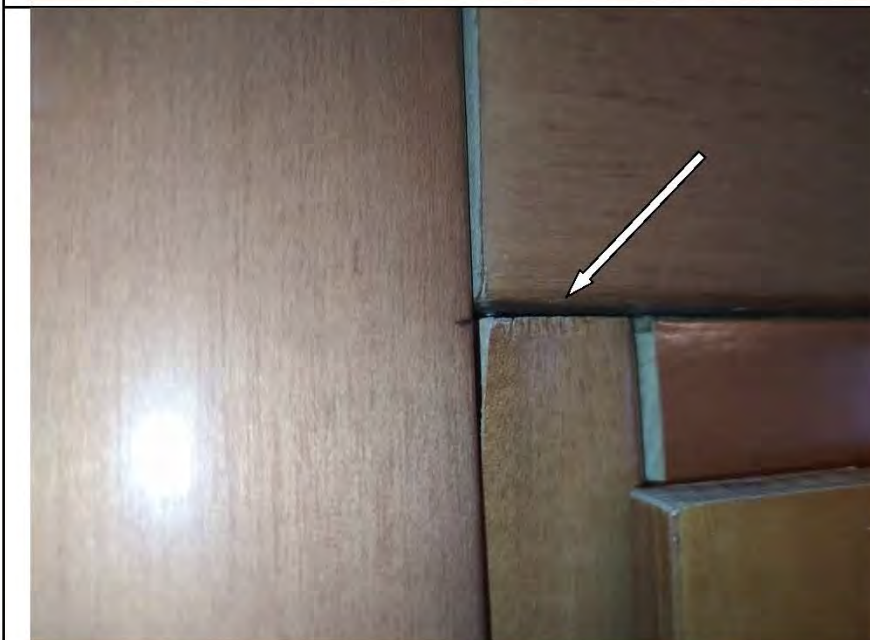
Фото №29. Коробка деревянного дверного блока имеет дефекты (отслоение ламинации от вздутия) в санузле, характерное последствиям залива.
