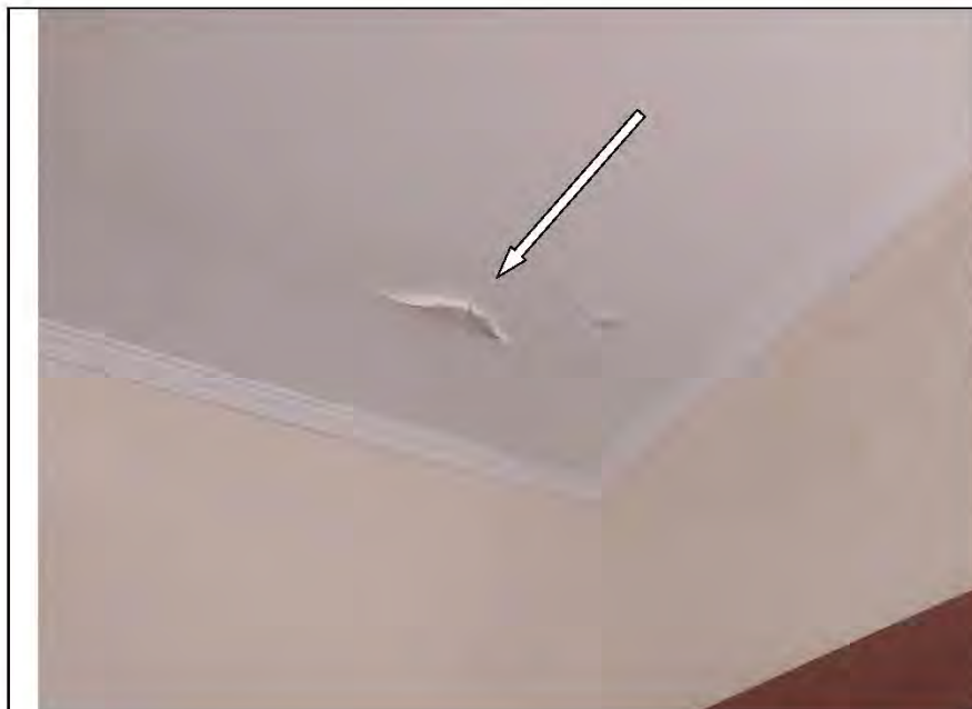
Фото №16. Шпаклеванная и окрашенная поверхность потолка в холле имеют дефекты, характерные последствиям залива (отслоения, следы заливия).
