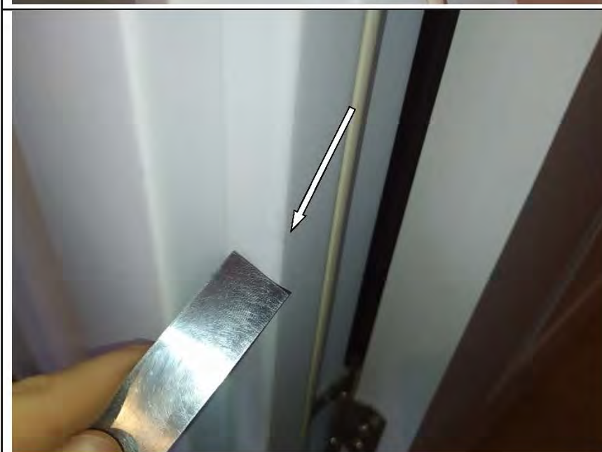
Фото №57. Коробка деревянного дверного блока в спальне имеет дефекты (скол).
