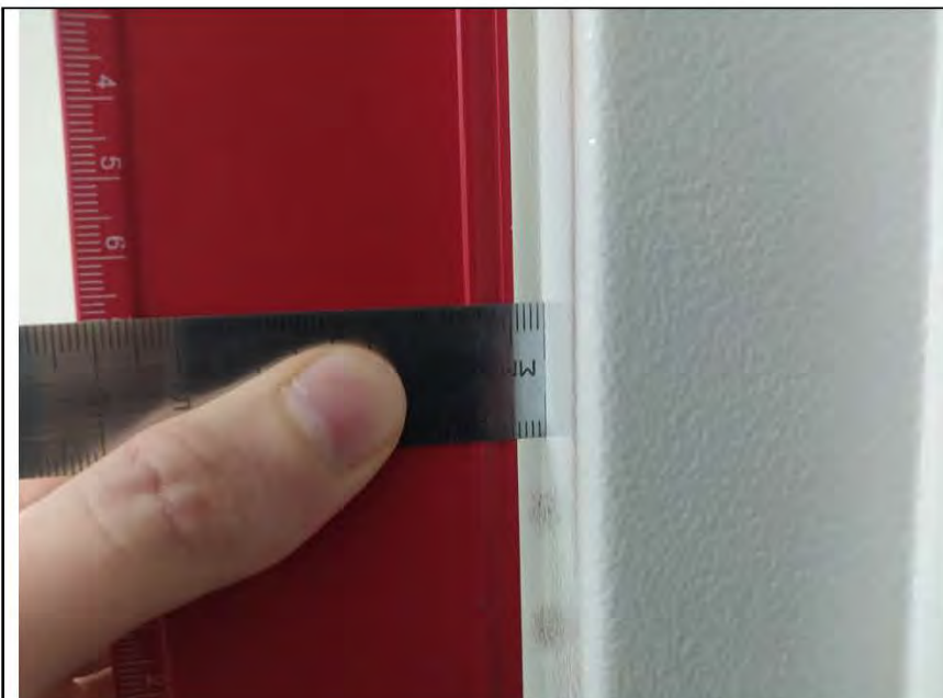
Фото №70. Отклонение коробки входного дверного блока
