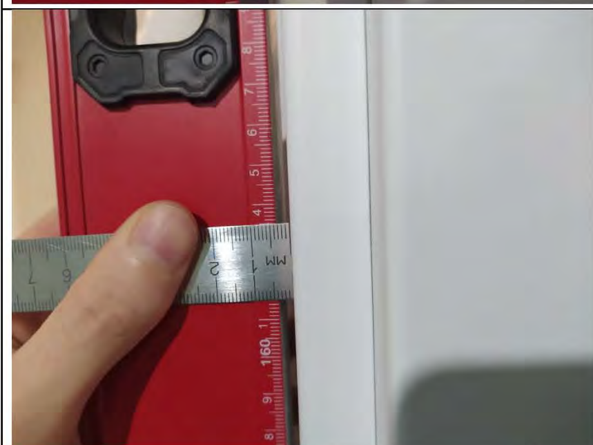
Фото №47. Отклонение наличников дверного блока в ванной комнате.
