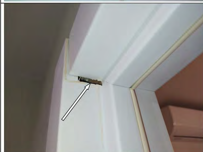
Фото №56. Элементы дверного блока соединены не надежно в ванной комнате.
