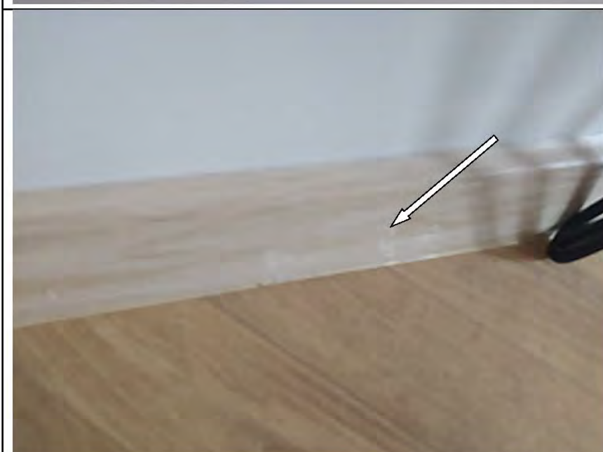
Фото №59. Загрязнение напольного плинтуса ПВХ в гостиной.
