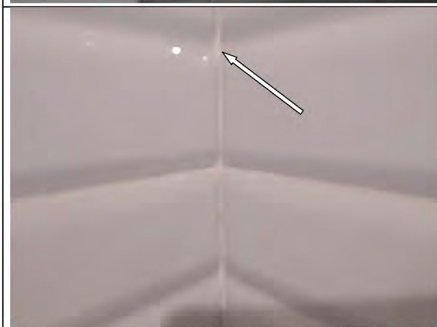
Фото №66. Затирка настенной плитки в санузле выполнена с нарушениями.
