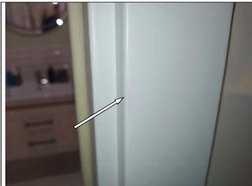
Фото №52. Наличник деревянного дверного блока в ванной комнате имеет дефекты (загрязнение лакокрасочными средствами).
