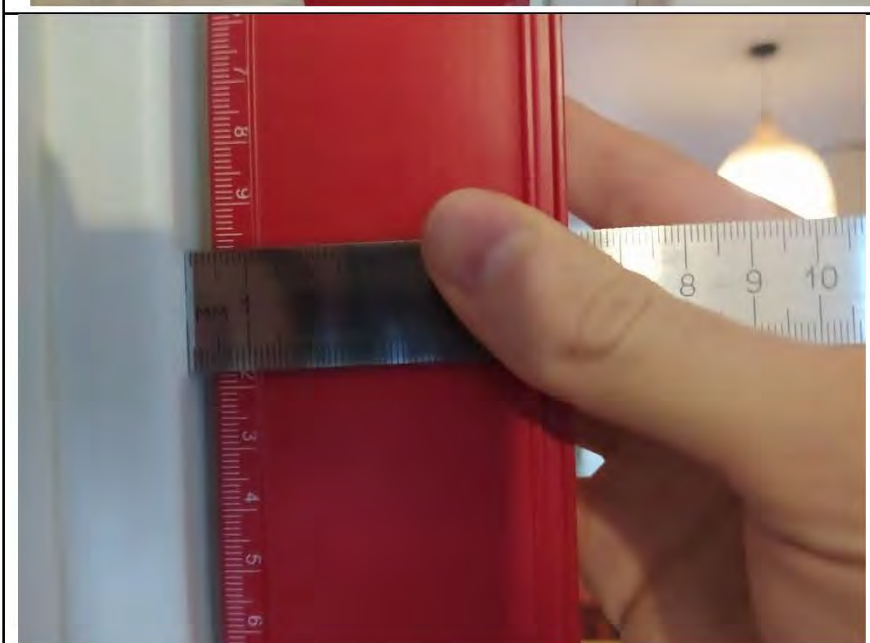
Фото №45. Отклонение коробки дверного блока в спальне.
