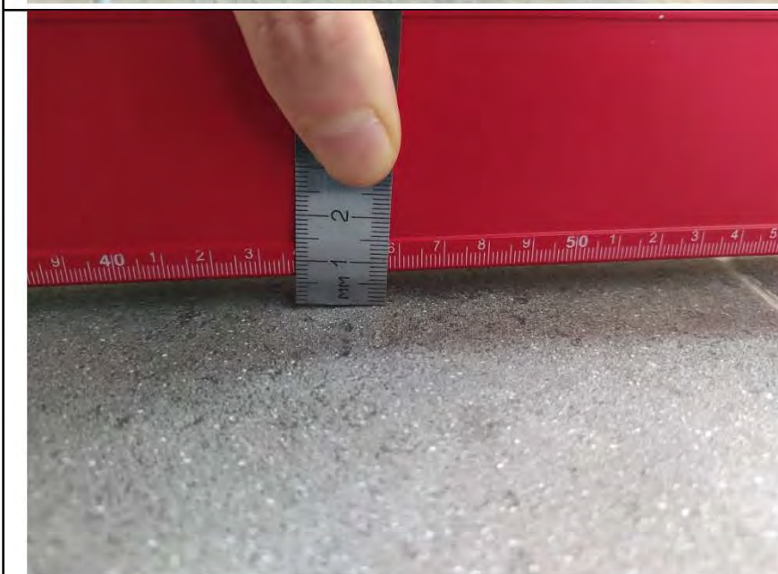
Фото №20. Измерения уровня напольного покрытия на лоджии (плитка).
