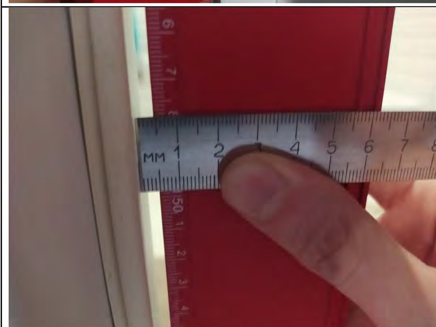
Фото №48. Отклонение наличников дверного блока в санузле.
