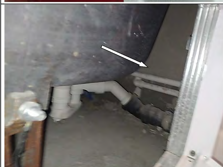
Фото №71. Частично отсутствует настенная керамическая плитка за ванной.
