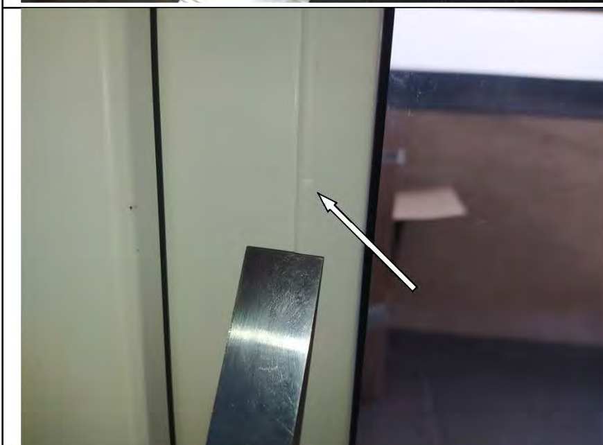
Фото №32. Профиль ПВХ дверного блока в спальне имеется дефект (механическое повреждение).
