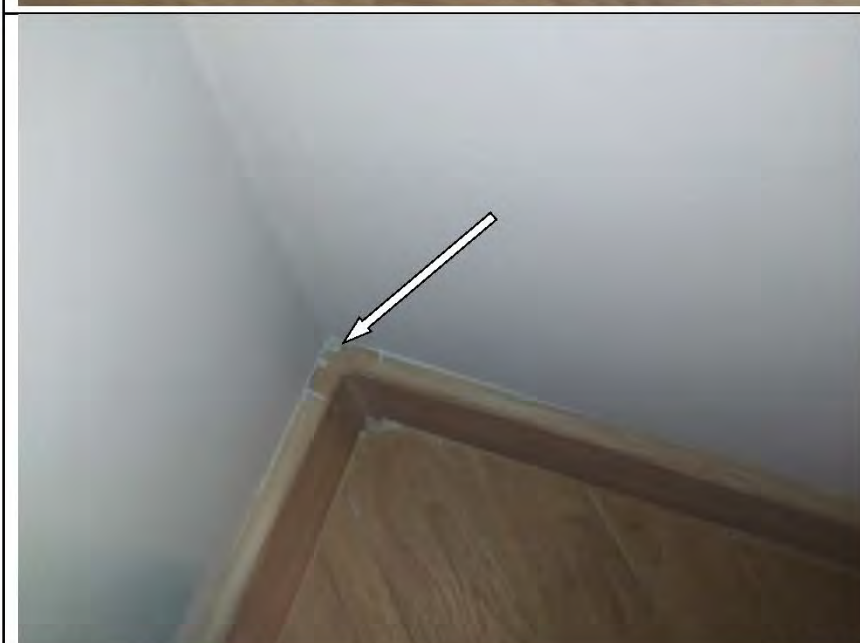
Фото №60. Загрязнение напольного плинтуса ПВХ в спальне.
