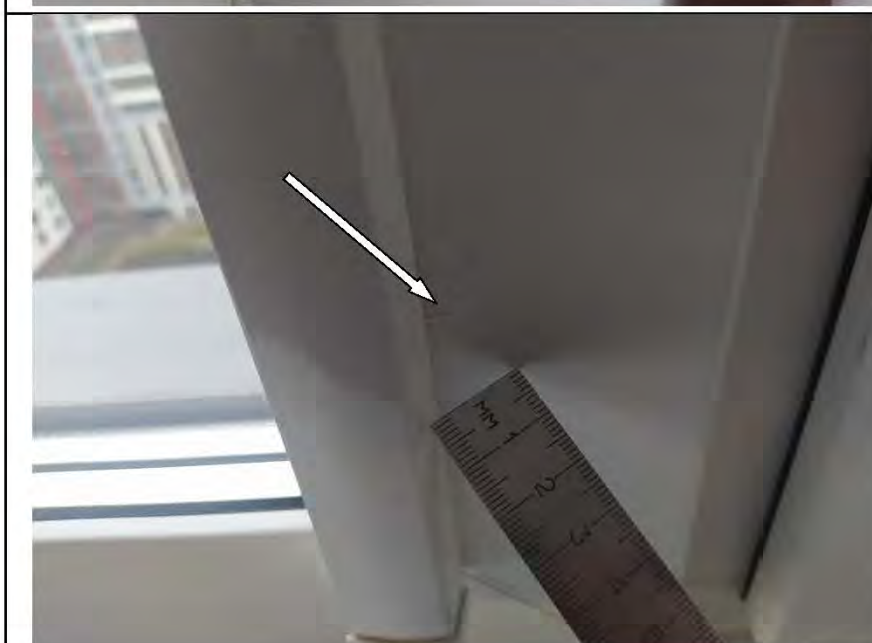
Фото №27. Профиль ПВХ оконного блока №1 в кухне имеет дефекты (царапина).
