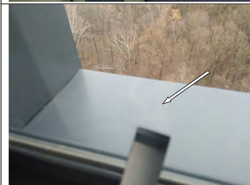
Фото №33. На стеклопакете оконного блока ПВХ в лоджии имеется дефект (окалина).
