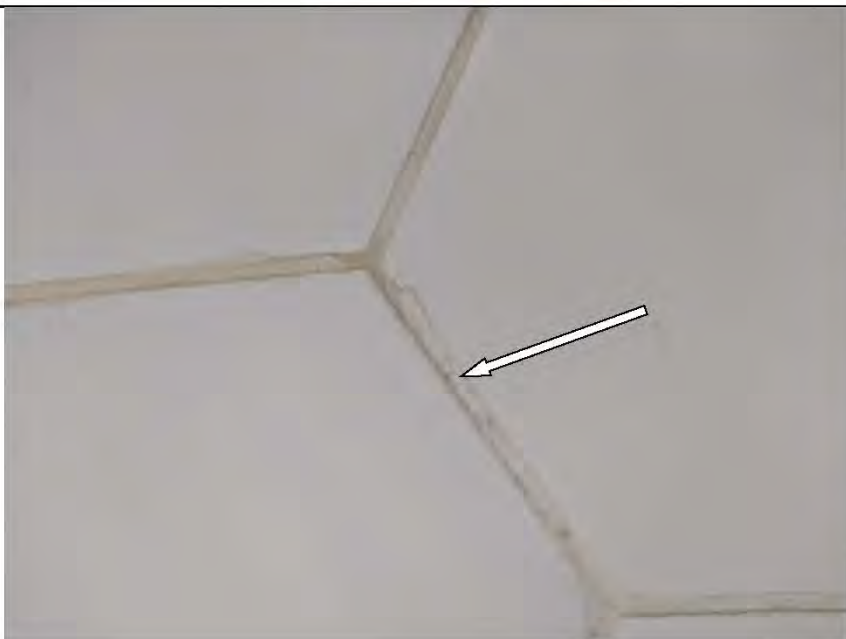
Фото №69. Затирка напольной плитки в кухне выполнена с нарушениями.
