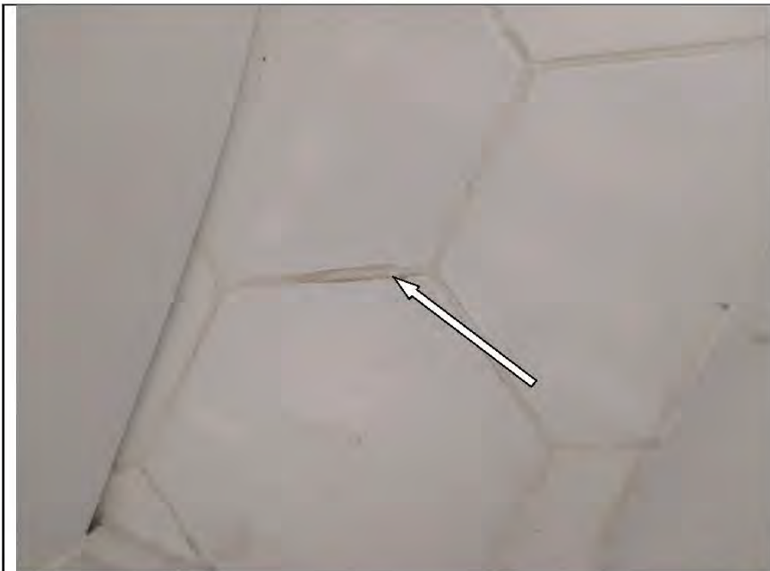
Фото №67. Затирка напольной плитки в санузле выполнена с нарушениями.
