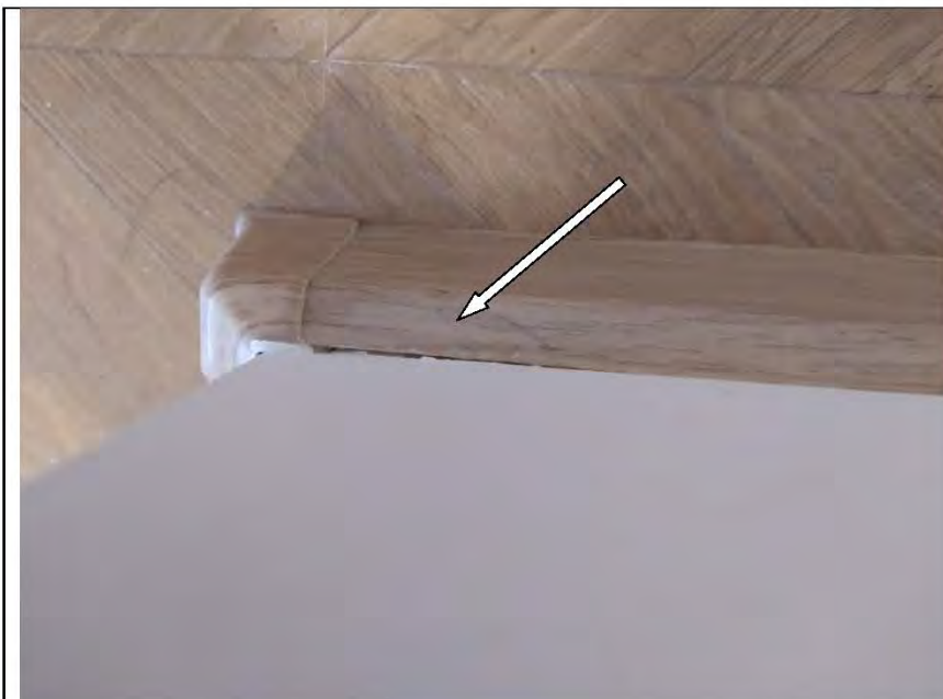
Фото №58. Напольный плинтус ПВХ в кухне неплотно прилегает к стене (отходит), образуется зазор.
