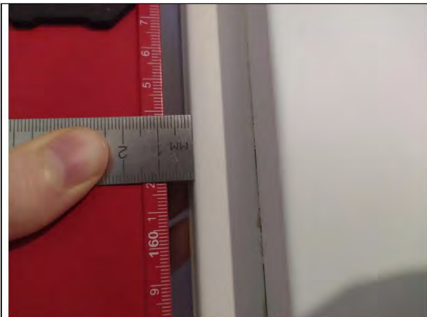
Фото №46. Отклонение коробки дверного блока в детской.
