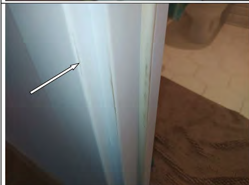
Фото №53. Наличник деревянного дверного блока в санузле имеет дефекты (притертость).
