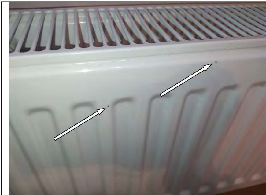
Фото №43. Кожух отопительного прибора в детской имеет дефект поверхности (сколы).
