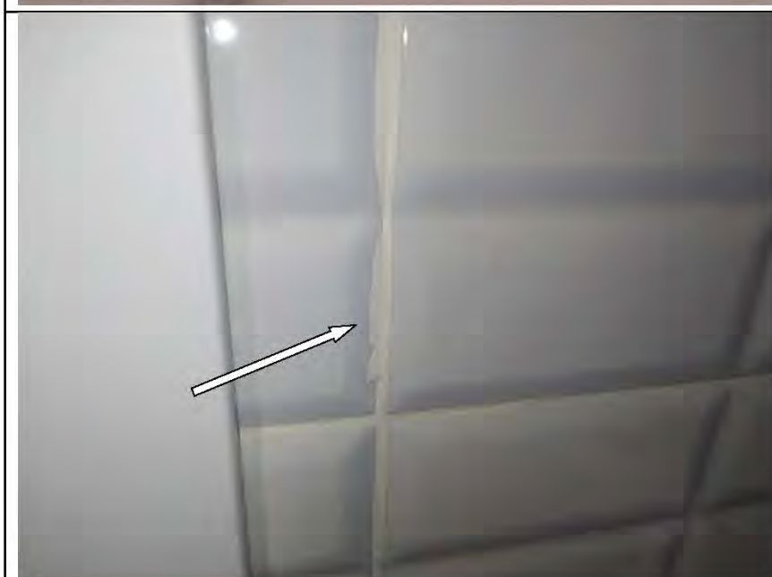
Фото №65. Затирка настенной плитки в ванной комнате выполнена с нарушениями.
