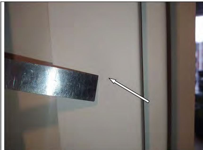
Фото №49. Наличник деревянного дверного блока в гостиной имеет дефекты (царапина).
