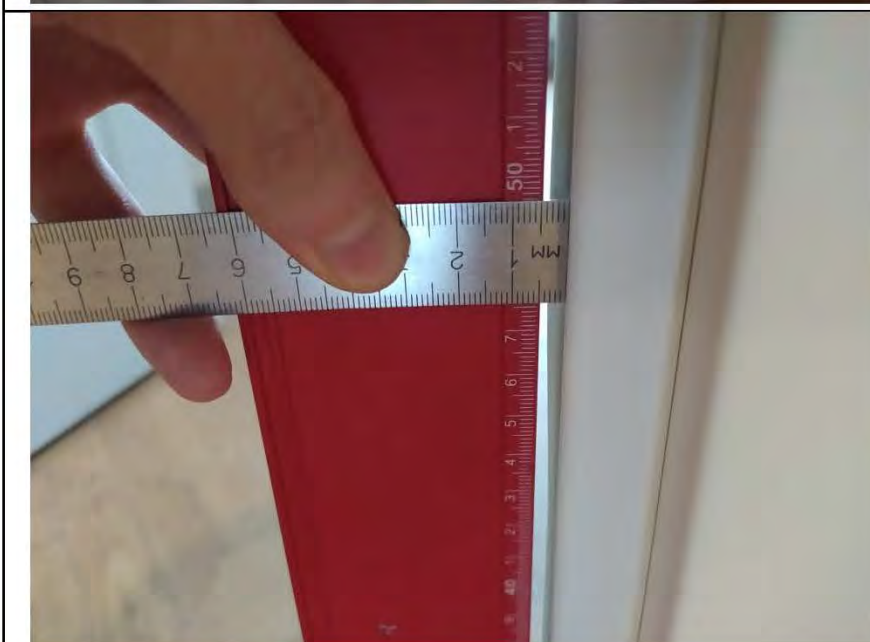
Фото №44. Отклонение коробки дверного блока в гостиной.
