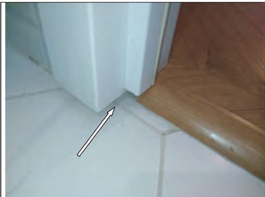
Фото №55. Коротко подрезан наличник деревянного дверного блока в ванной комнате.
