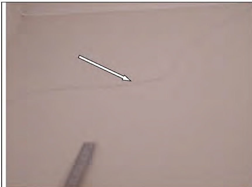
Фото №64. Шпаклеванные и окрашенные стены в спальне имеют дефекты (трещины).
