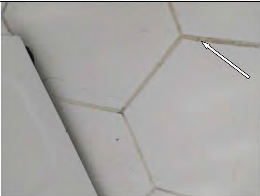
Фото №68. Затирка напольной плитки в ванной комнате выполнена с нарушениями.
