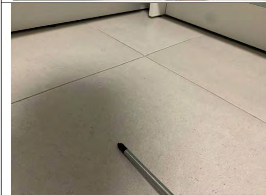
Фото №21 Пустоты при простукивании напольной плитки на кухне
