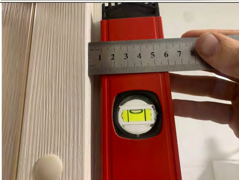
Фото №11 Отклонение смонтированного дверного блока ванной от вертикали
