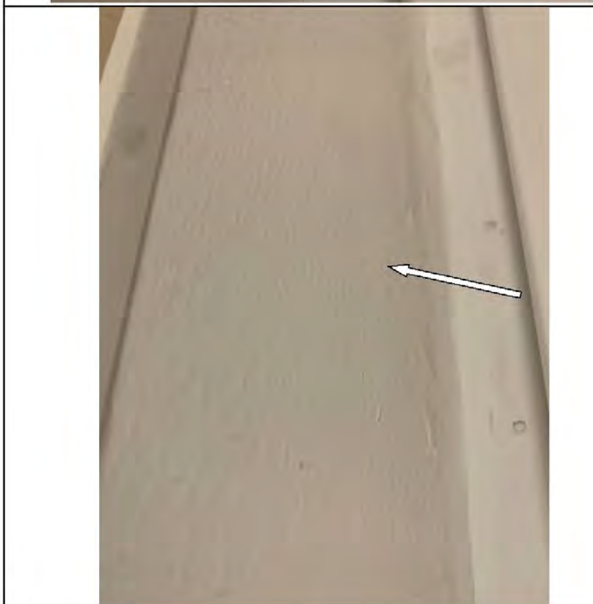
Фото №25 Полосы, следы от инструмента и подтёки водоэмульсионной краски при проведении малярных работ в комнате 1.
