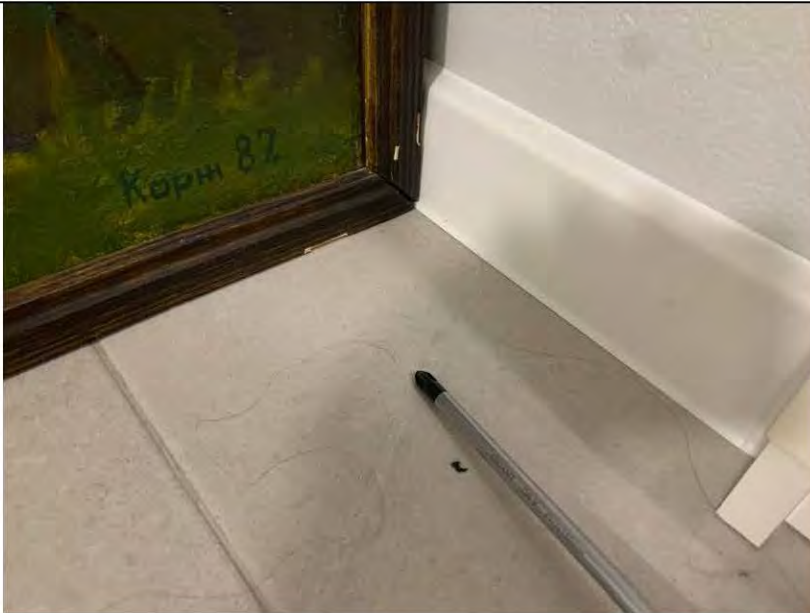
Фото №4 Пустоты при простукивании напольной плитки в прихожей.
