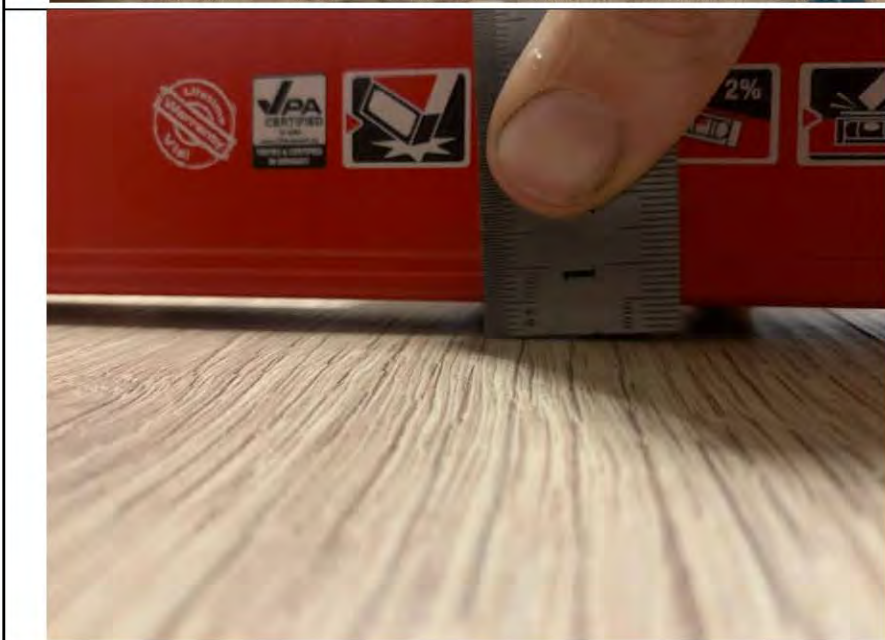
Фото №28 Отклонение уровня пола в комнате 1
