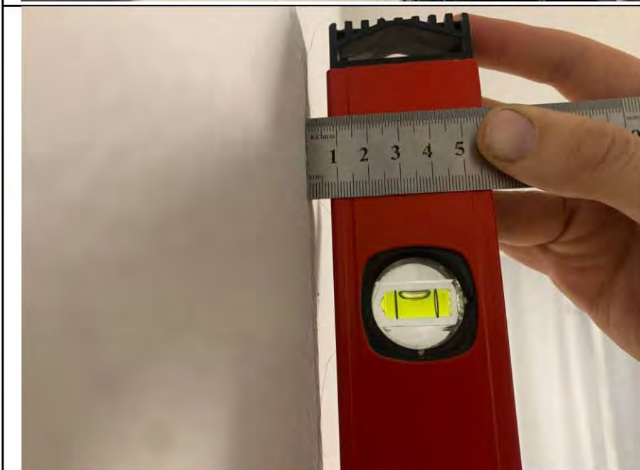
Фото №17 Отклонение стены на кухне от вертикали
