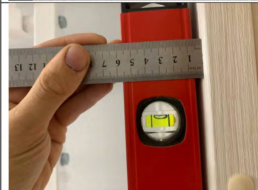
Фото №14 Отклонение смонтированного дверного блока комнаты 1 от вертикали
