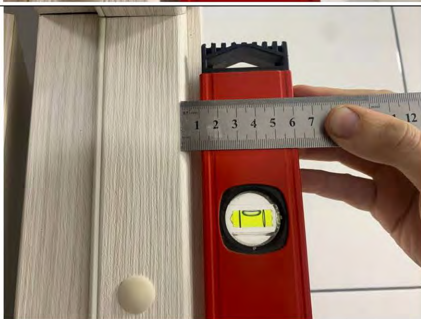
Фото №12 Отклонение смонтированного дверного блока санузла от вертикали
