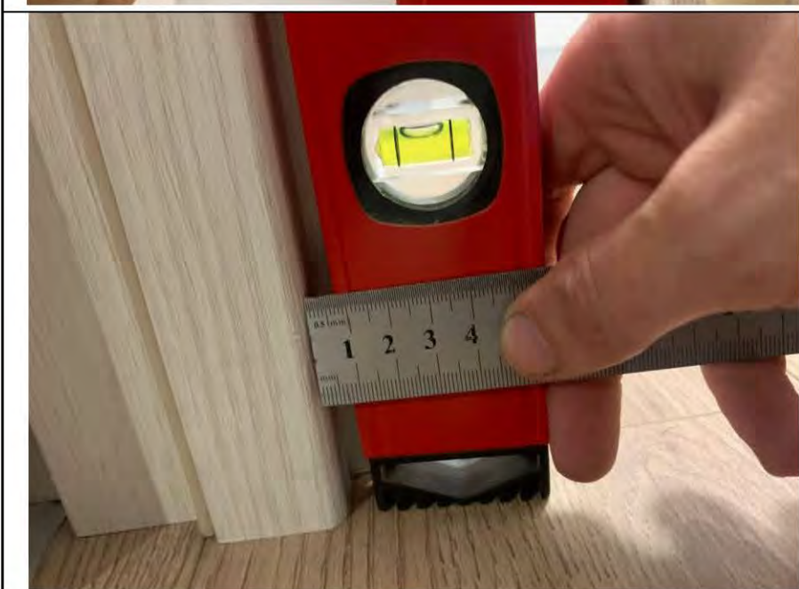
Фото №15 Отклонение смонтированного дверного блока комнаты 2 от вертикали
