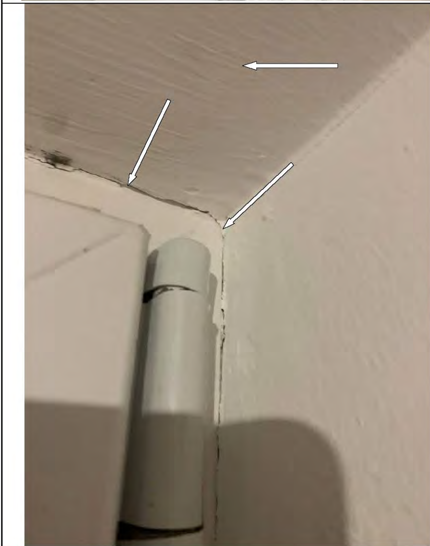
Фото №30 Трещины в зоне монтажных швов оконного блока комнаты 2. Полосы, следы от инструмента на откосах при малярных работах.
