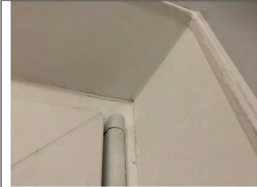
Фото №19 Трещины в зоне устройства монтажного шва оконного блока на кухне.
