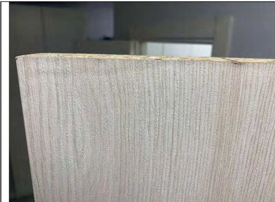
Фото №13 Заусенцы ламинированного слоя дверного полотна санузла
