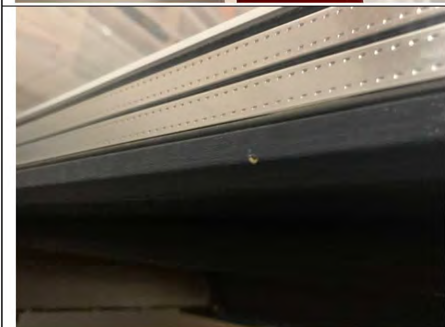
Фото №18 Отслоение ламинированного слоя профиля балконного блока на кухне
