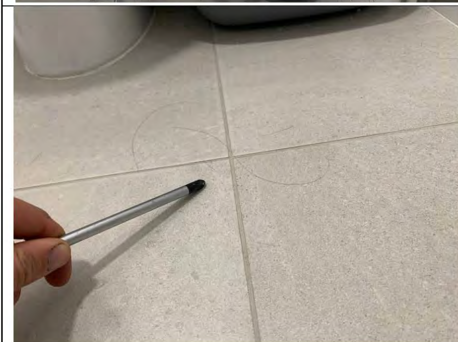
Фото №42 Пустоты при простукивании напольной плитки в санузле.
