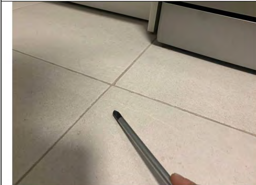
Фото №20. Пустоты при простукивании напольной плитки на кухне
