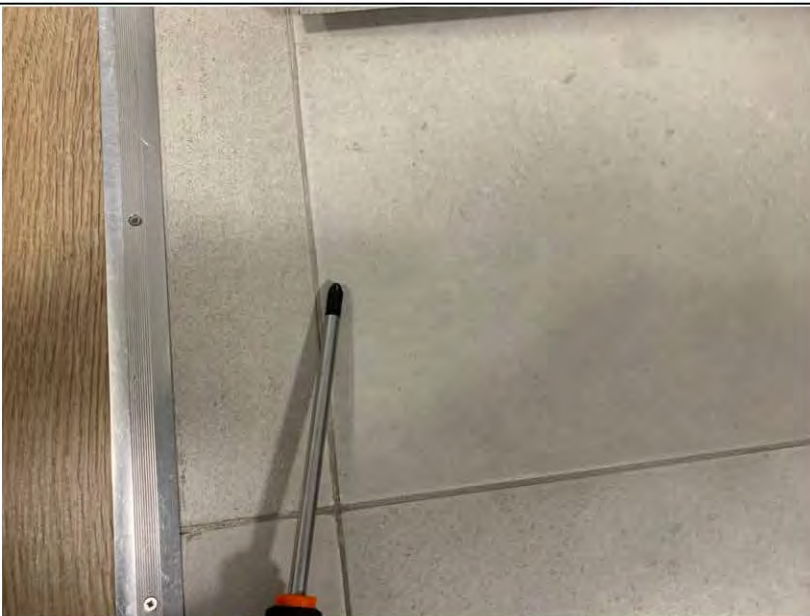
Фото №5 Пустоты при простукивании напольной плитки в прихожей.
