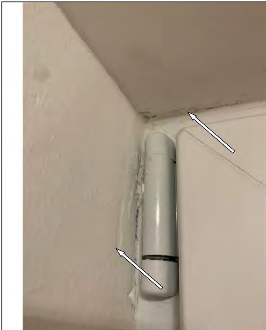
Фото №24 Трещины в зоне монтажного шва примыкания оконного блока к проёму в комнате 1. Полосы и подтёки водоэмульсионной краски при проведении малярных работ.
