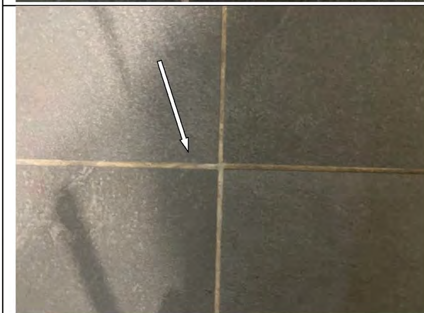
Фото №33. Неровные швы напольной керамической плитки в коридоре.
