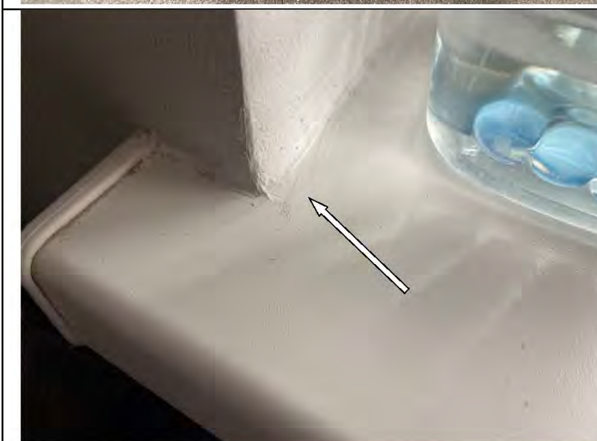
Фото №45. Дефект на лицевой стороне подоконной доски оконного блока ПВХ в спальне.
