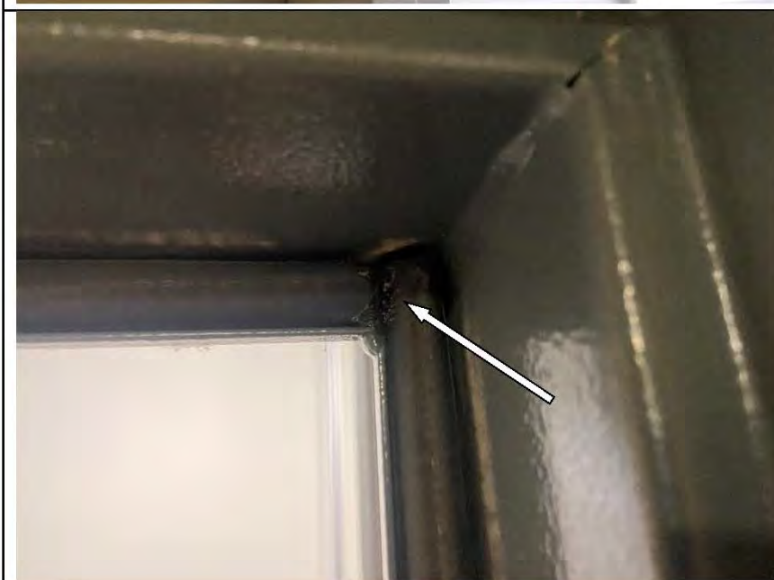
Фото №81. Дефект на уплотнительной противопожарной ленте входного дверного блока в коридоре.
