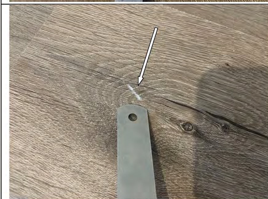
Фото №42. Дефект на напольном покрытии из ламината в спальне.
