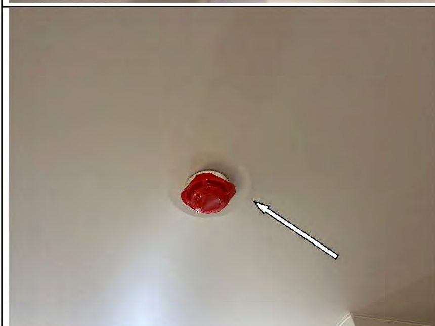
Фото №83. Дефект на поверхности натяжного потолка в коридоре.
