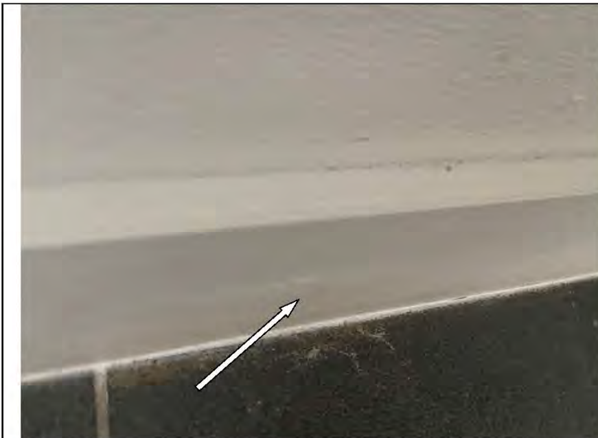
Фото №40. Дефект на напольном деревянном плинтусе в кухне.
