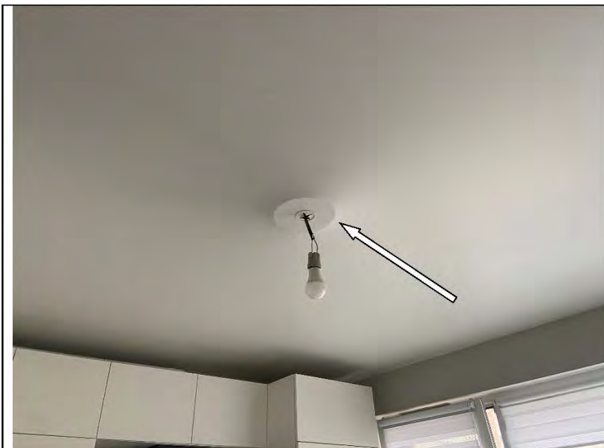
Фото №88. Дефект на поверхности натяжного потолка в кухне.
