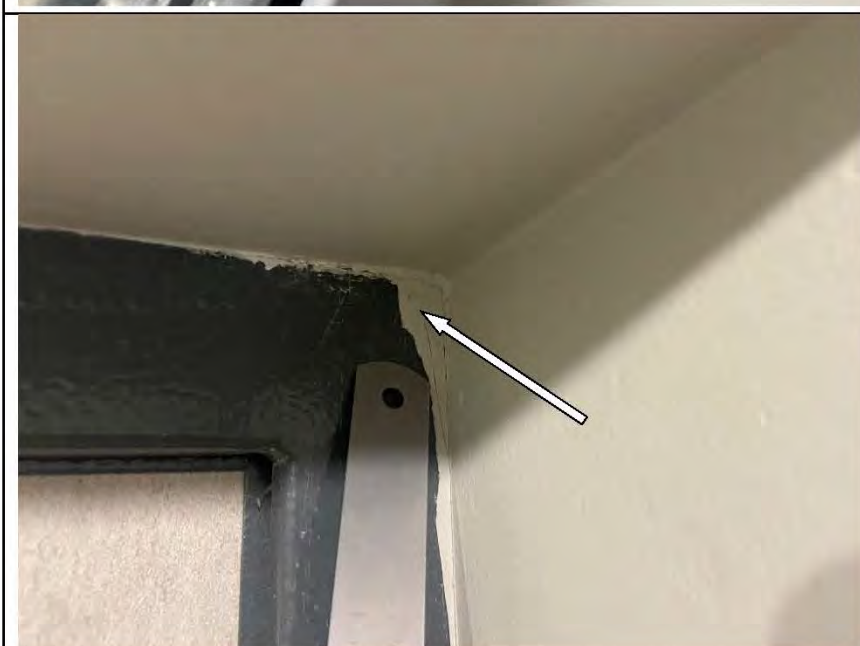
Фото №63. Дефект на коробке входного дверного блока в коридоре.
