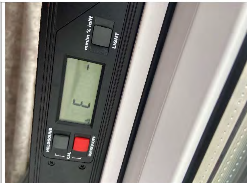
Фото №58. Отклонение от вертикали оконного блока ПВХ в детской.
