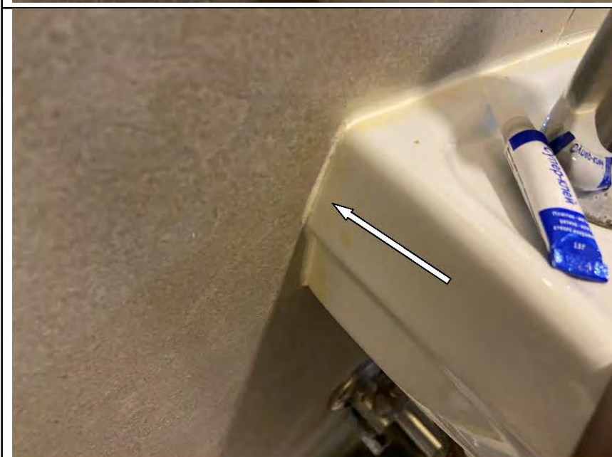
Фото №95. Загрязнения на раковине в санузле.
