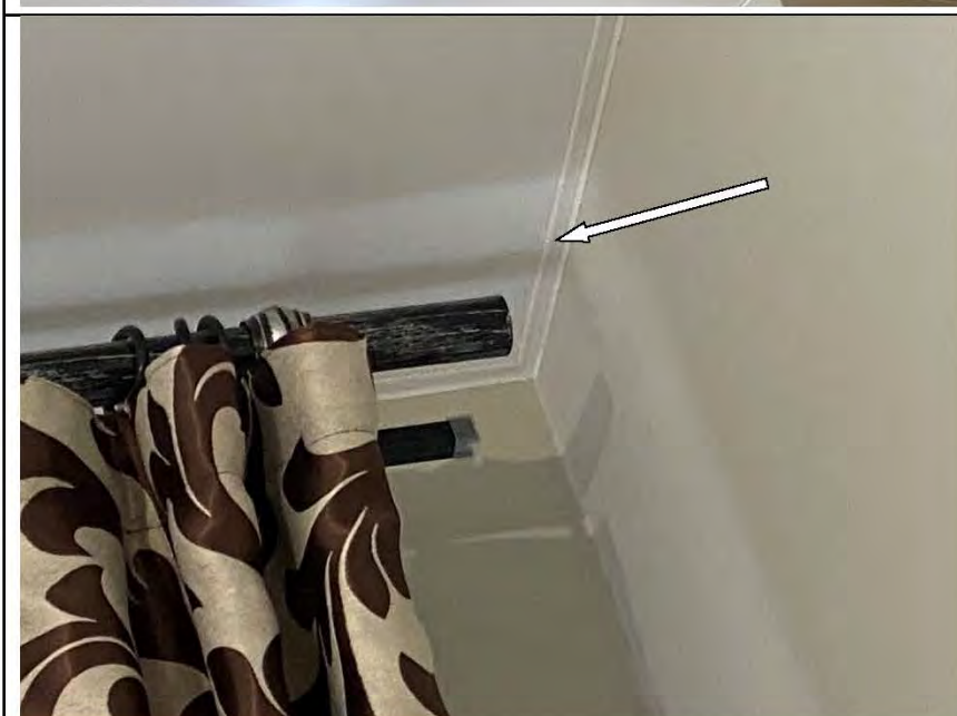
Фото №84. Дефект на поверхности натяжного потолка в спальне.
