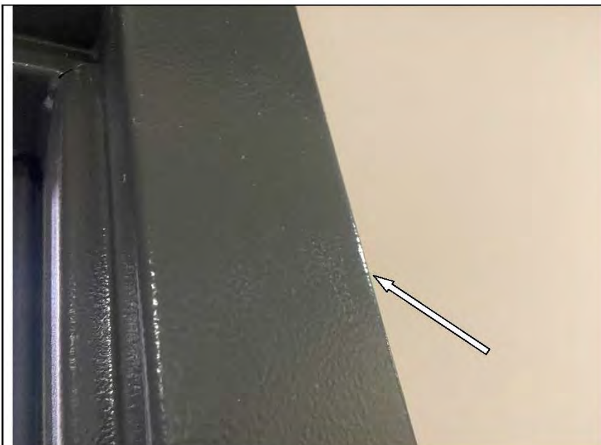
Фото №70. Дефект на наличниках входного дверного блока в коридоре.
