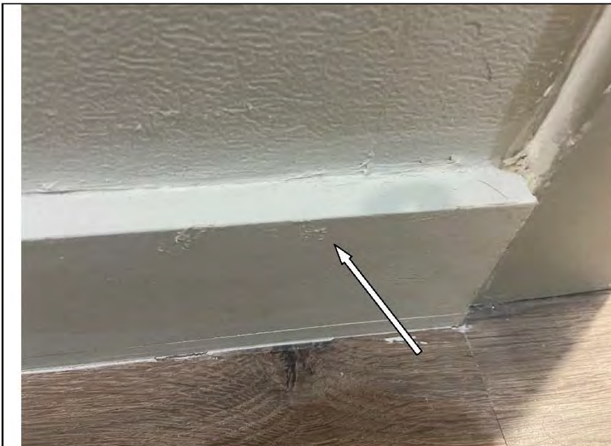
Фото №37. Дефект на напольном деревянном плинтусе в коридоре.
