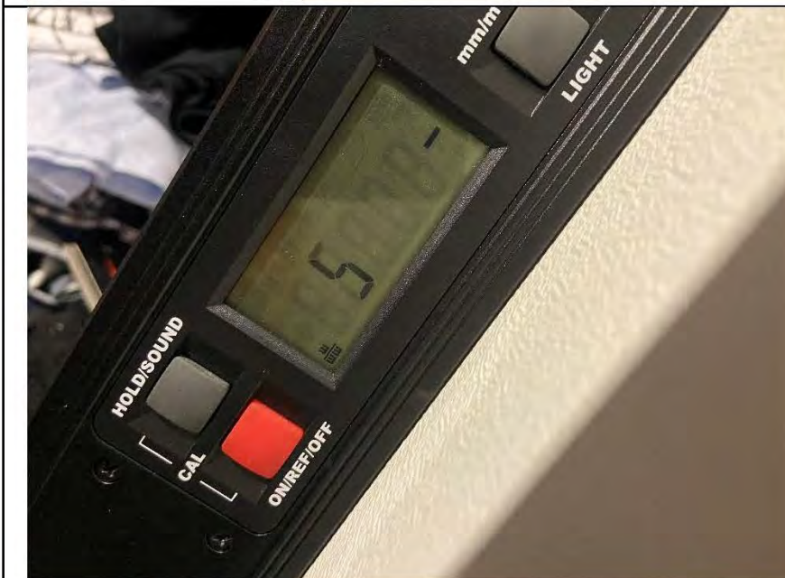
Фото №11. Отклонение поверхности стен от вертикали в гардеробной.
