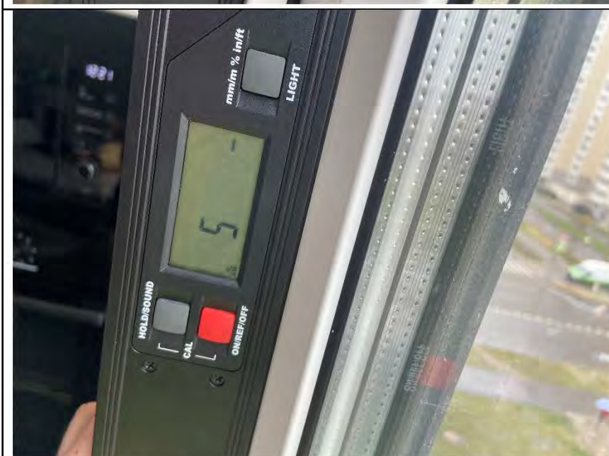
Фото №59. Отклонение от вертикали оконного блока ПВХ в кухне.
