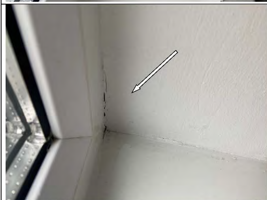
Фото №56. Неровности, выбоины, раковины на окрашенных откосах оконного блока ПВХ в кухне.
