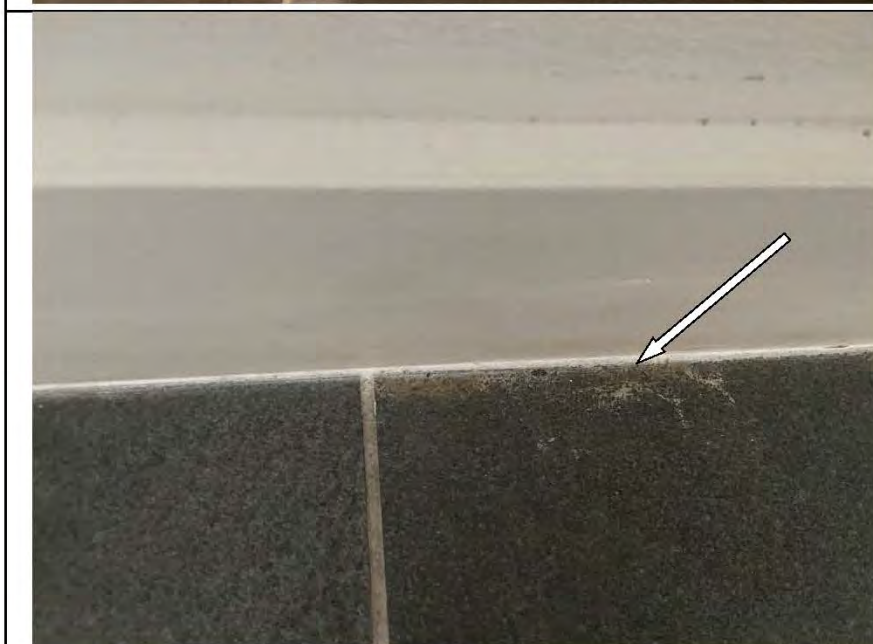
Фото №32. Загрязнения на напольной керамической плитке в кухне.
