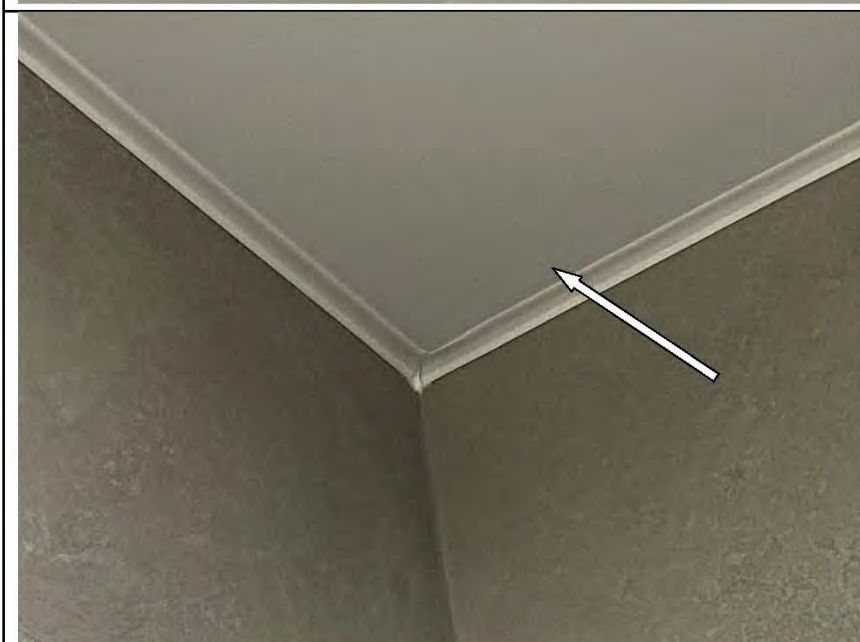
Фото №86. Дефект на поверхности натяжного потолка в ванной комнате.
