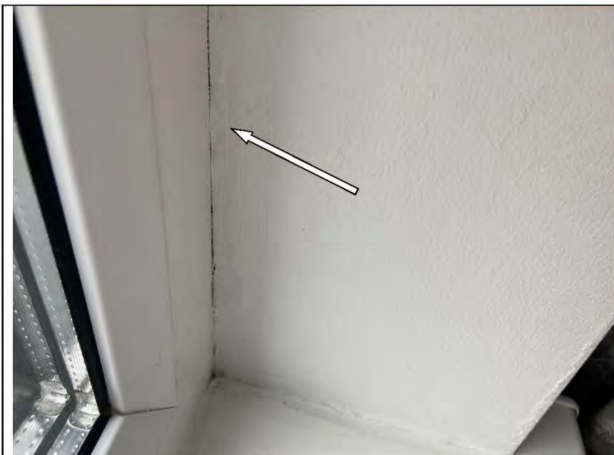
Фото №55. Неровности, выбоины, раковины на окрашенных откосах оконного блока ПВХ в детской.
