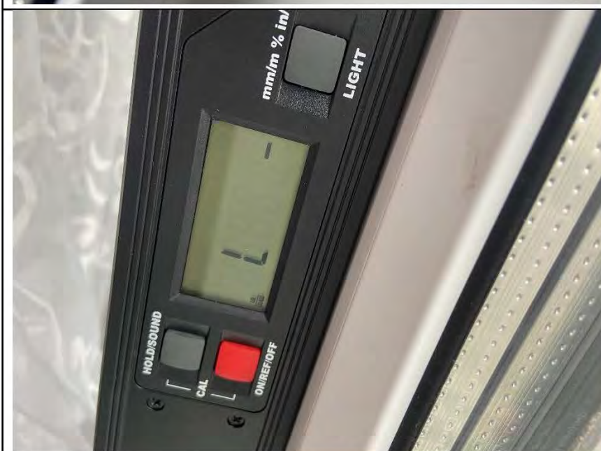
Фото №57. Отклонение от вертикали оконного блока ПВХ в спальне.
