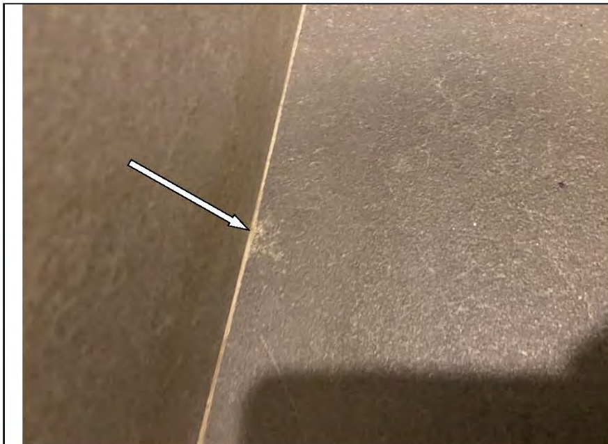
Фото №31. Загрязнения на напольной керамической плитке в санузле.
