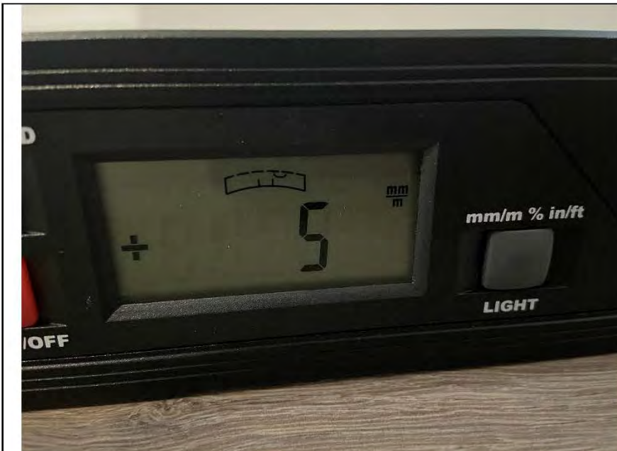
Фото №22. Отклонение поверхности напольного покрытия из ламината в спальне.
