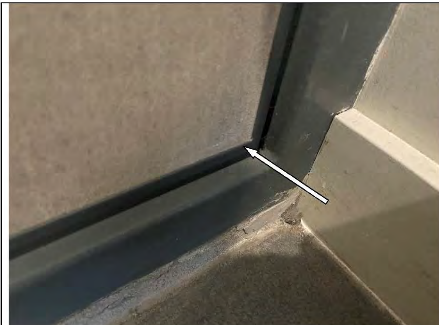
Фото №64. Дефект на полотне входного дверного блока в коридоре.
