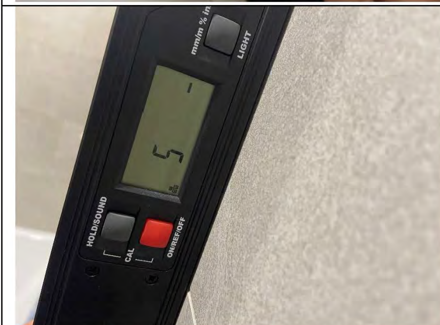
Фото №14. Отклонение поверхности стен от вертикали в ванной комнате.
