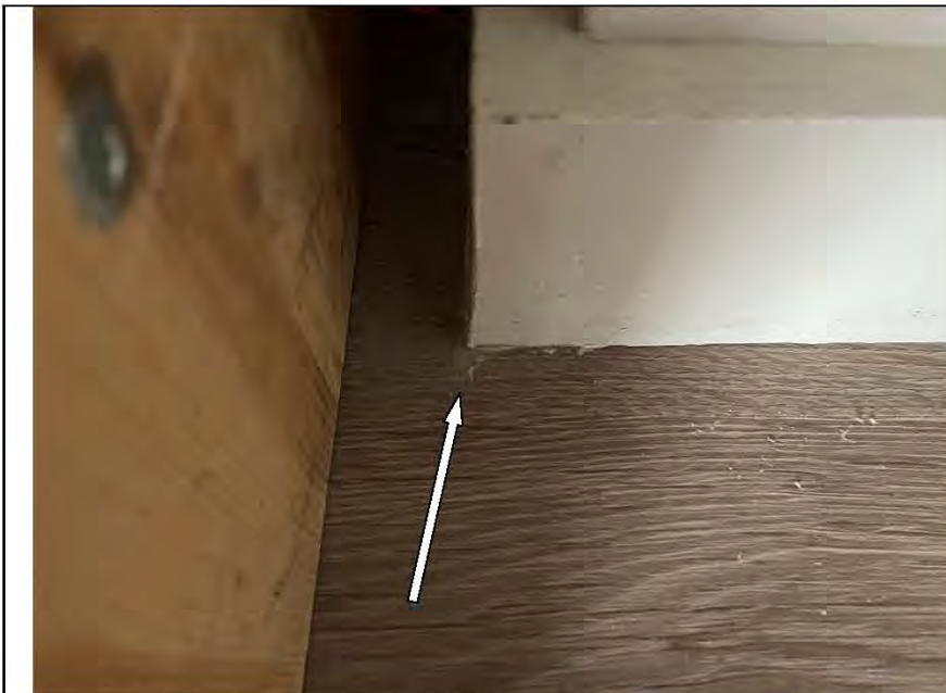
Фото №43. Дефект на напольном покрытии из ламината в детской.
