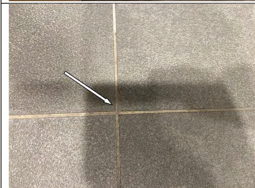
Фото №44. Скол на напольной керамической плитке в ванной комнате.
