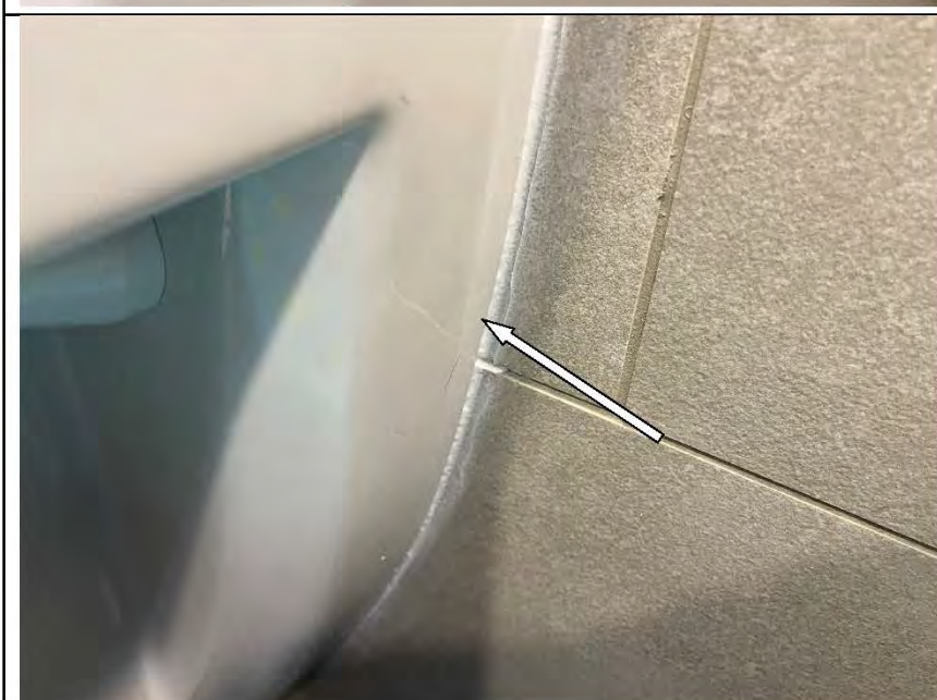
Фото №93. Загрязнения на унитазе в ванной комнате.
