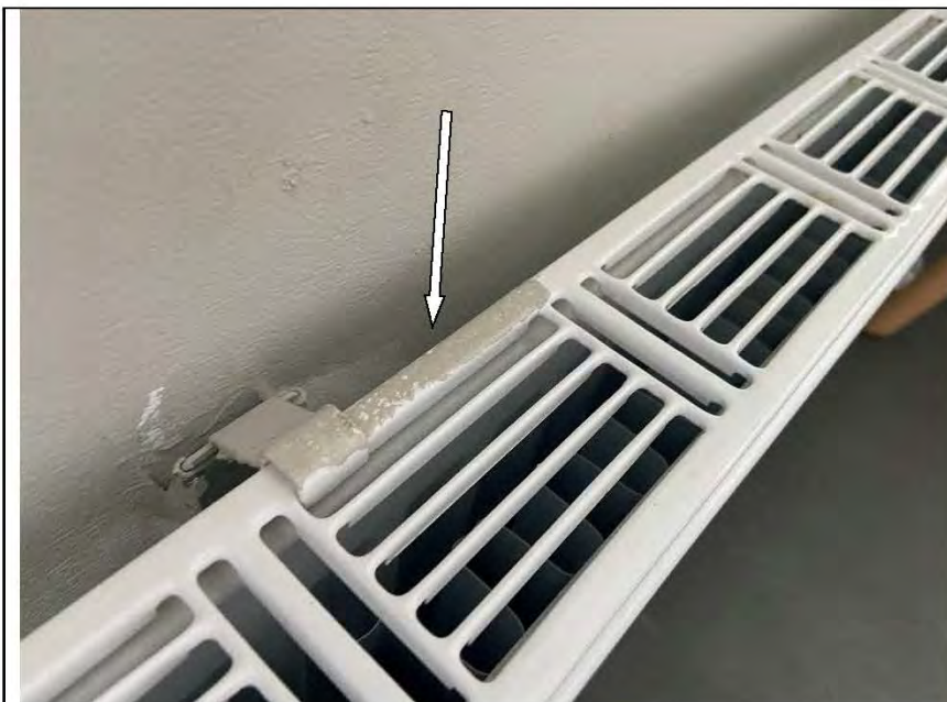
Фото №91. Дефект на поверхности металлического кожуха отопительного прибора в кухне.
