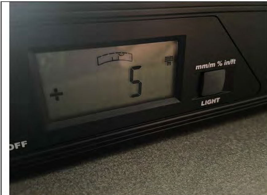
Фото №28. Отклонение поверхности напольного покрытия из керамической плитки в кухне.
