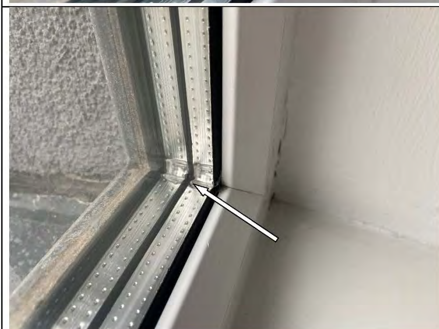
Фото №62. Дефект на уплотнительной ленте оконного блока ПВХ в кухне.
