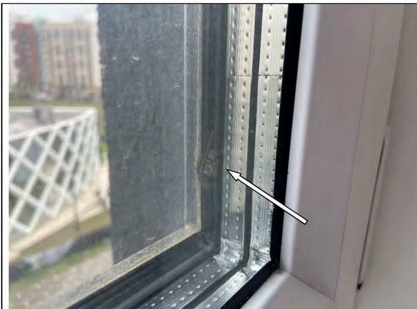
Фото №61. Дефект на уплотнительной ленте оконного блока ПВХ в детской.
