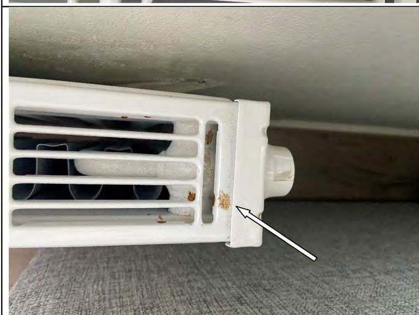
Фото №90. Дефект на поверхности металлического кожуха отопительного прибора в детской.
