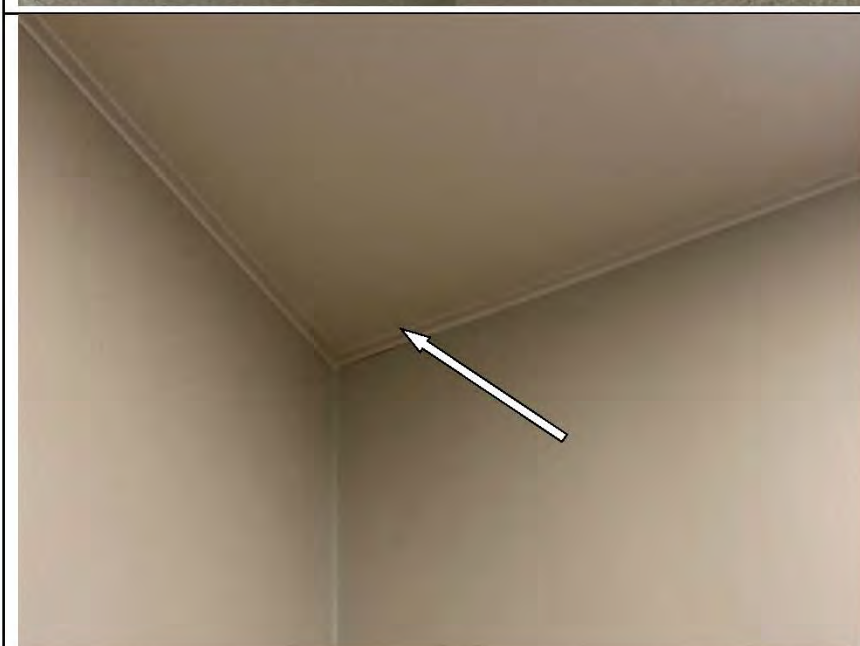
Фото №87. Дефект на поверхности натяжного потолка в санузле.
