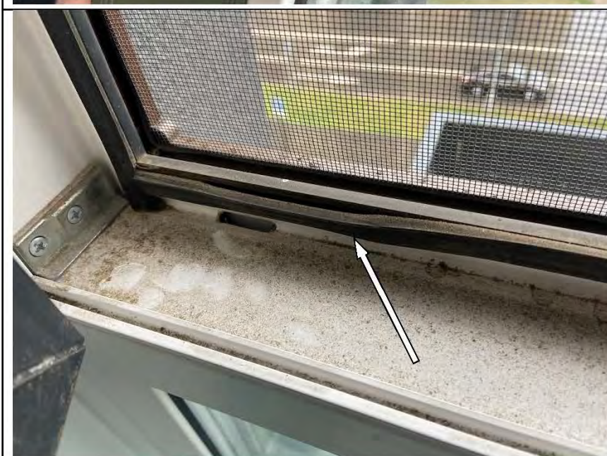
Фото №60. Дефект на уплотнительной ленте оконного блока ПВХ в спальне.
