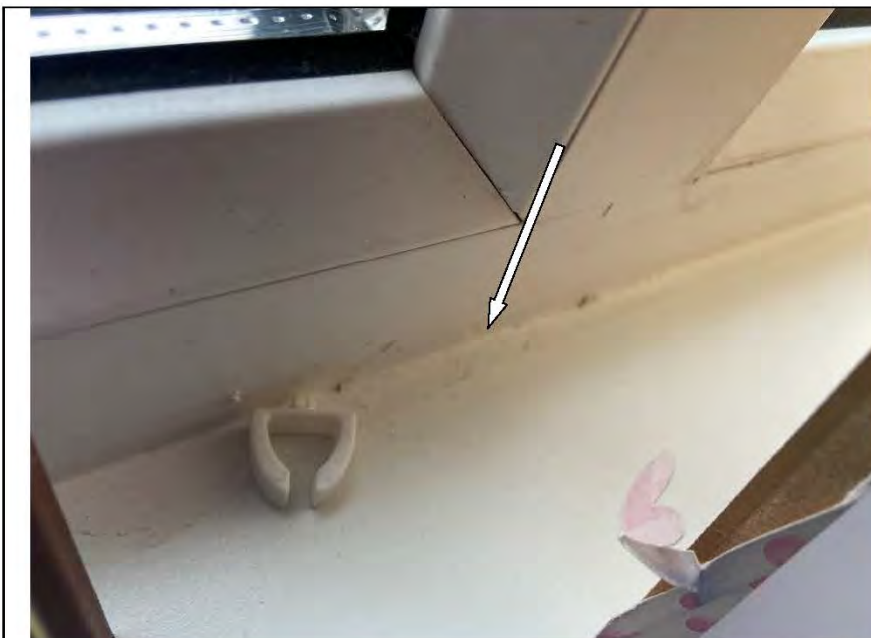
Фото №46. Дефект на лицевой стороне подоконной доски оконного блока ПВХ в детской.
