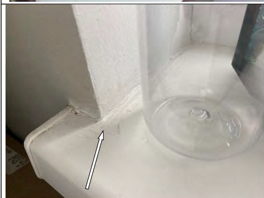
Фото №47. Дефект на лицевой стороне подоконной доски оконного блока ПВХ в кухне.
