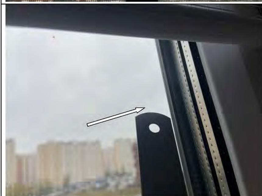
Фото №53. Царапина на стеклопакете оконного блока ПВХ в кухне.
