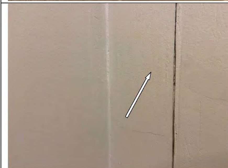
Фото №20. Неровности, подтеки, выбоины на окрашенных стенах в санузле.
