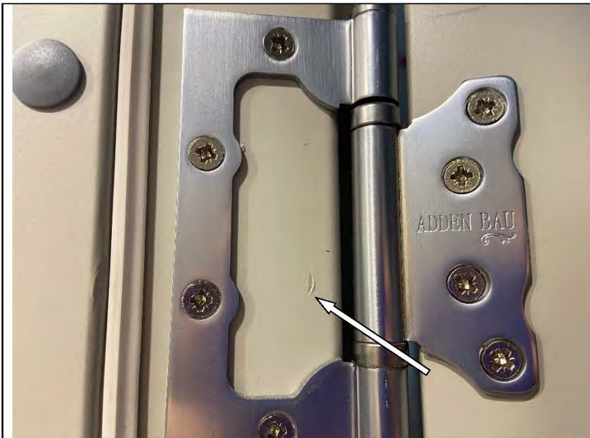
Фото №67. Дефект на полотне деревянного дверного блока в ванной комнате.
