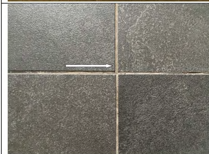
Фото №36. Неровные швы напольной керамической плитки в кухне.
