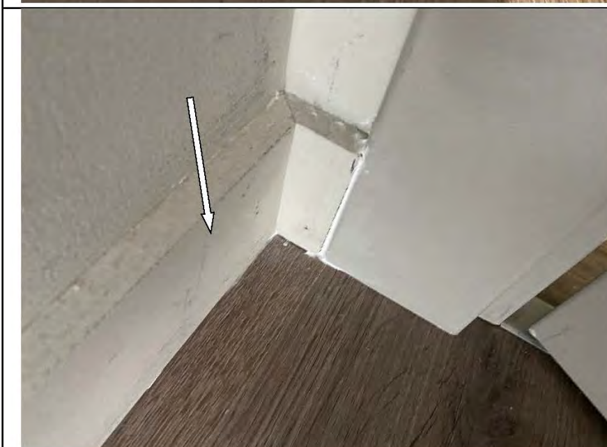
Фото №39. Дефект на напольном деревянном плинтусе в детской.
