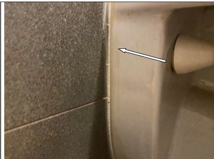
Фото №94. Загрязнения на унитазе в санузле.
