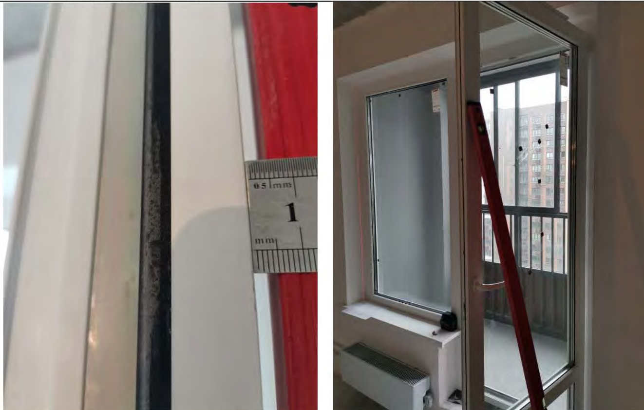
Фото 126-127. Комната 2 (15,5 кв.м.) 7.5 Отклонение балконной двери оконного блока от плоскости 4,5 мм
