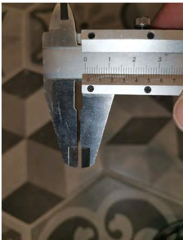
Фото 69-71. Санузел/ванная (3,5 кв.м.) 4.6 Уступ между смежными напольными керамическими плитками 1,0 мм, 1,5 мм
