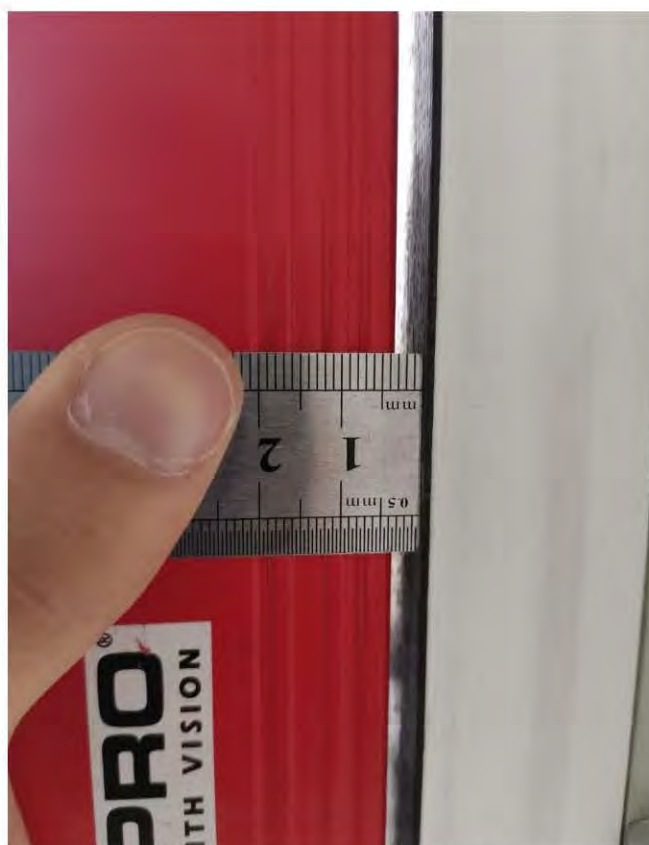
Фото 107-109. Кухня (10,7 кв.м.) 6.6 Отклонение оконной створки оконного блока от плоскости 2,5 мм, 4,0 мм, 3,5 мм
