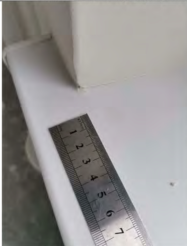
Фото 110. Кухня (10,7 кв.м.) 6.7 Царапина на подоконной доске
