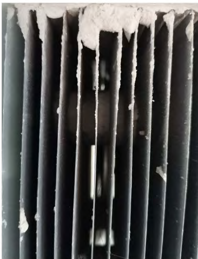
Фото 128. Комната 2 (15,5 кв.м.) 7.6 Загрязнены соты радиатора
