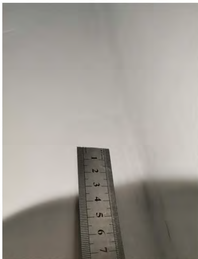
Фото 116-122. Комната 2 (15,5 кв.м.) 7.2 Некачественная подготовка стен
