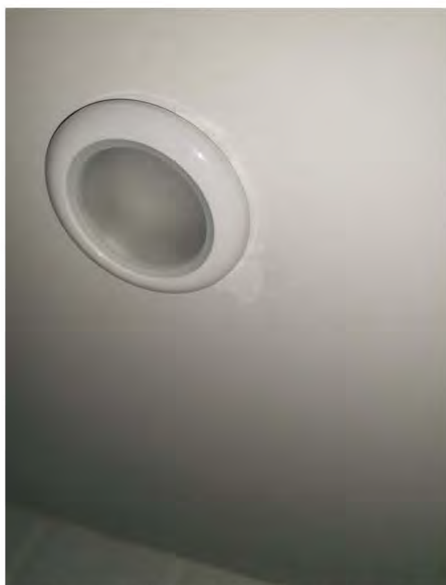
Фото 63-65. Санузел/ванная (3,5 кв.м.) 4.4 Загрязнения на полотне потолка
