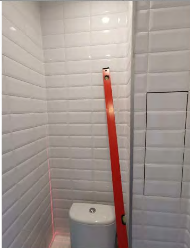
Фото 45-49. Санузел (1,3 кв.м.) 3.1 Отклонение на участке стены из керамической плитки от вертикали 5,5 мм, 11 мм
