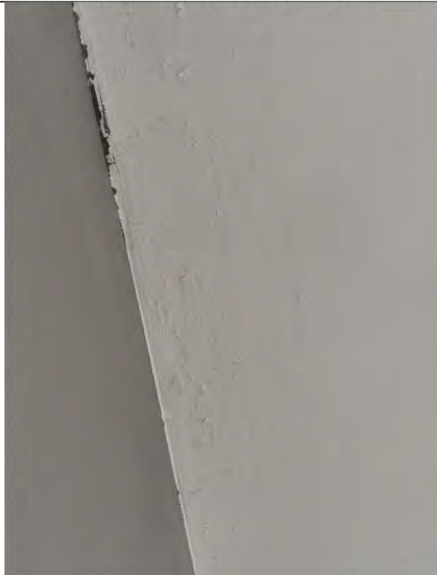
Фото 136. Лоджия (4,0 кв.м.) 8.4 Некачественная подготовка потолка
