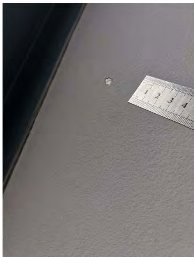
Фото 137. Лоджия (4,0 кв.м.) 8.5 Локальный участок окрашенных стен имеет: скол
