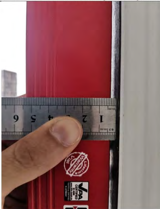
Фото 88-90. Комната 1 (9,8 кв.м.) 5.6 Отклонение оконной створки оконного блока от плоскости 3,5 мм, 3,5 мм, 3,5 мм
