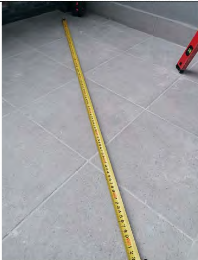
Фото 139-141. Лоджия (4,0 кв.м.) 8.7 Отклонение напольного покрытия от горизонтального уровня 10 мм на все помещение
