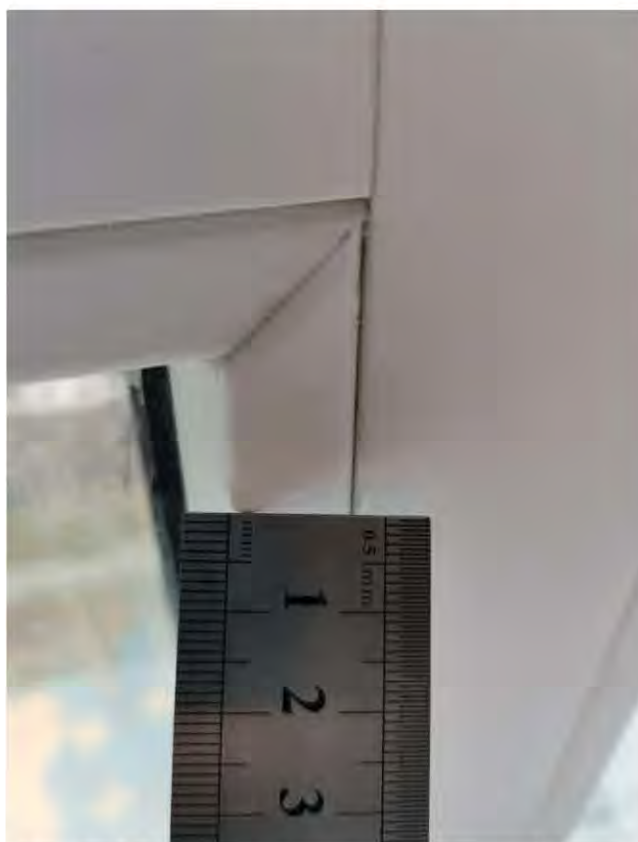
Фото 111. Кухня (10,7 кв.м.) 6.8 Наличие царапин на лицевой поверхности оконного блока
