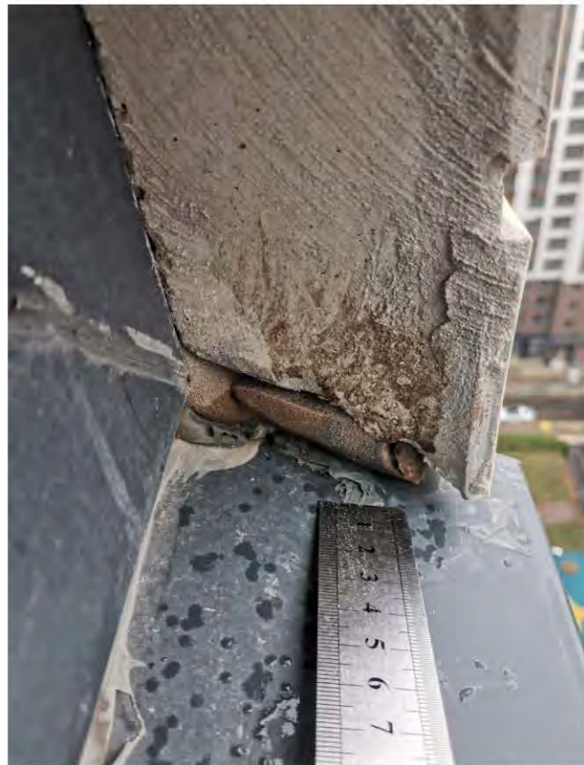
Фото 106. Кухня (10,7 кв.м.) 6.5 Отсутствует герметизация в месте соединения откоса и оконного отлива
