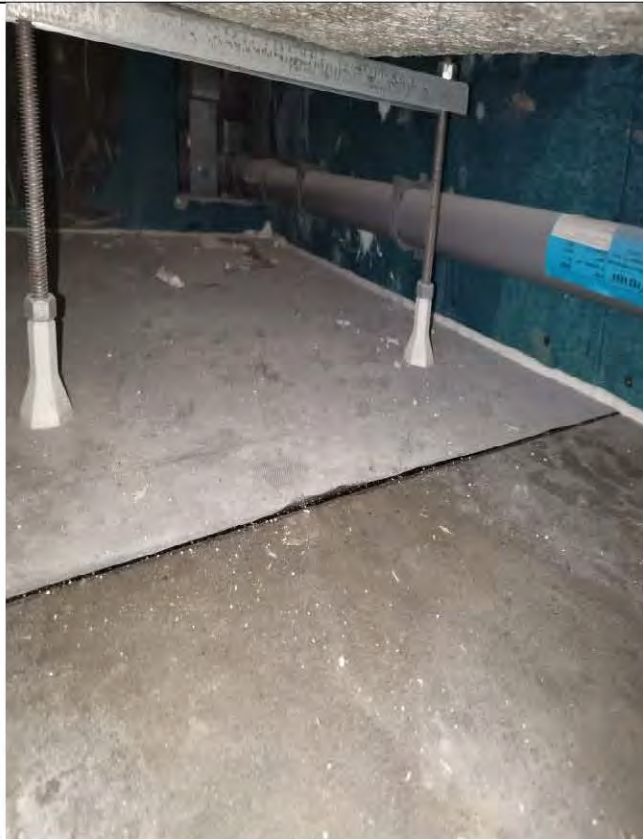
Фото 60. Санузел/ванная (3,5 кв.м.) 4.2 Укладка напольной плитки выполнена не в полном объеме
