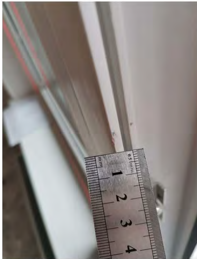
Фото 125. Комната 2 (15,5 кв.м.) 7.4 Наличие цапаины на лицевой поверхности оконного блока
