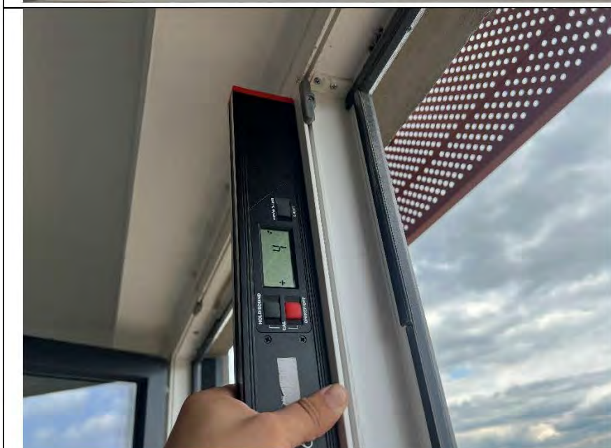
Фото №62. Отклонение оконного блока в спальне по уровню вертикальности составляет 4 мм.
