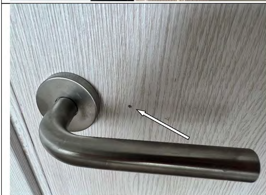
Фото №74. Скол на лицевой поверхности полотна деревянного дверного блока в спальне.
