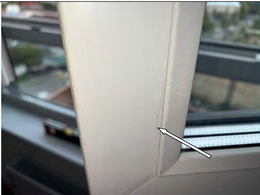
Фото №56. Царапины на профиле ПВХ оконного блока в кухне.
