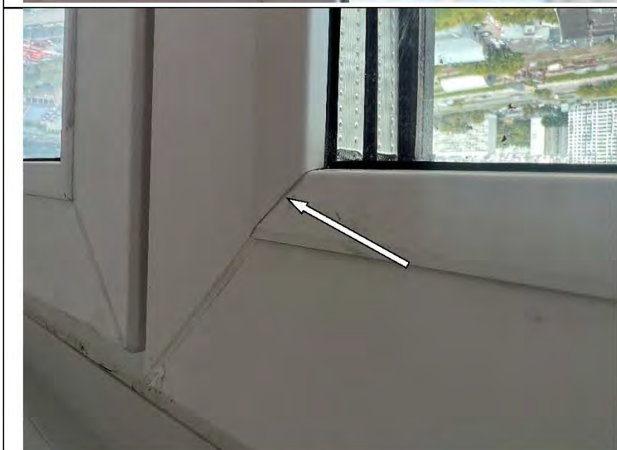
Фото №59. Зазор в стыке профилей ПВХ оконного блока в гостиной.
