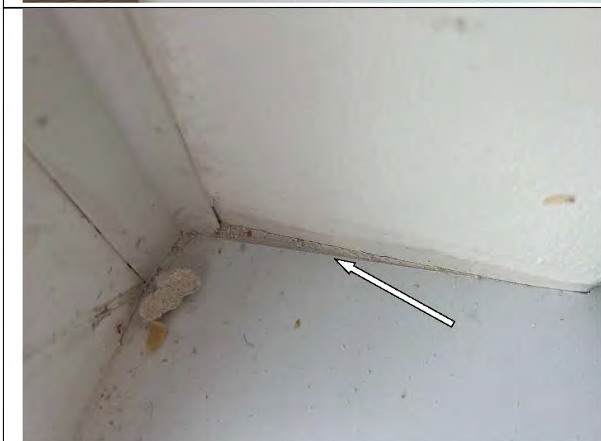
Фото №41. Торец подоконной доски в не заходит за откос в кухне.
