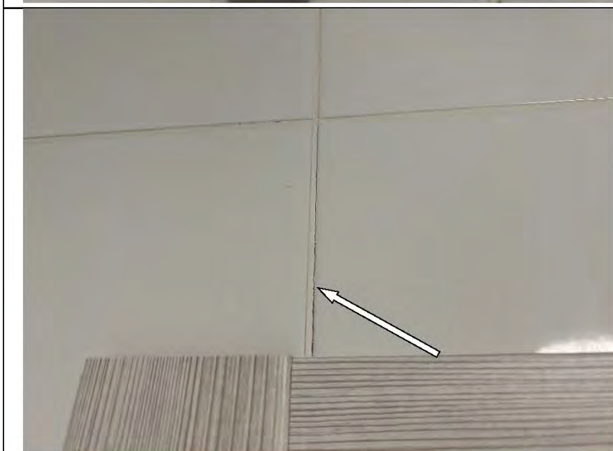
Фото №24. Трещина затирочного раствора в шовном пространстве настенной керамической плитки в ванной комнате.
