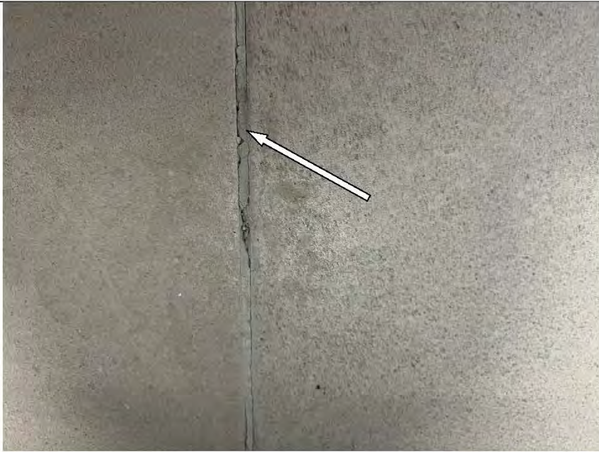
Фото №34. Трещина затирочного раствора в шовном пространстве напольной керамической плитки в ванной комнате.
