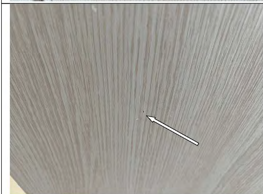
Фото №75. Скол на лицевой поверхности полотна деревянного дверного блока в санузле.
