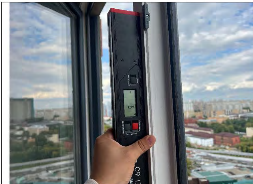
Фото №64. Отклонение оконного блока в гостиной по уровню вертикальности составляет 6 мм.
