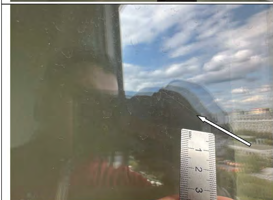
Фото №50. Царапины на стеклопакете оконного блока ПВХ в гостиной.
