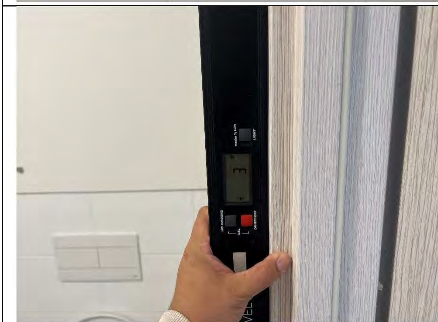
Фото №72. Отклонение наличников дверного блока от прямолинейности составляет 3 мм в ванной комнате.
