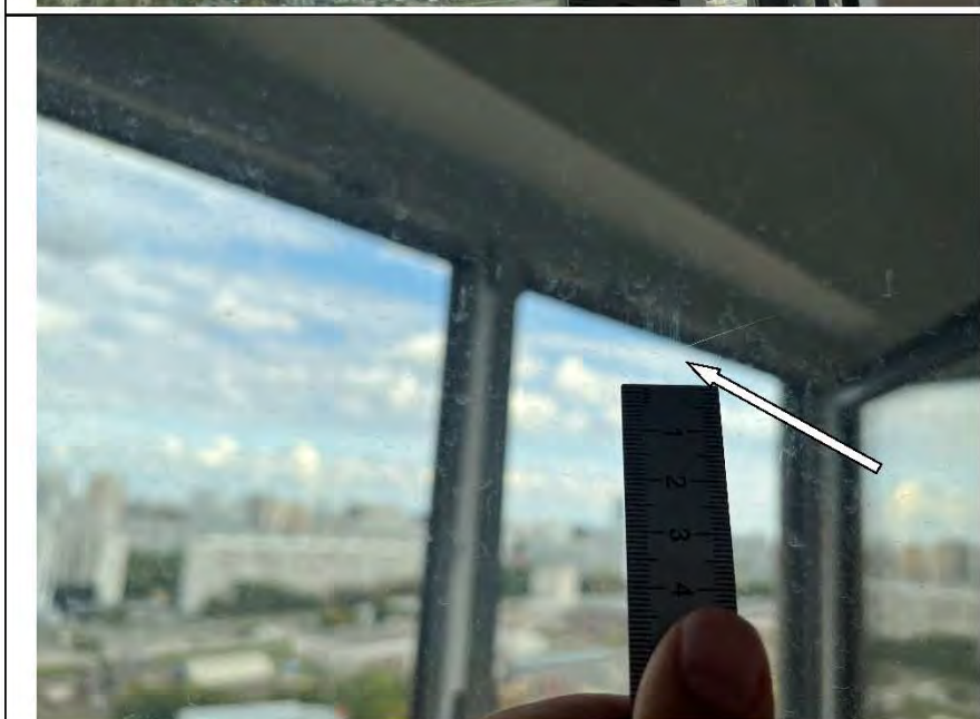
Фото №48. Царапины на стеклопакете оконного блока ПВХ в спальне.
