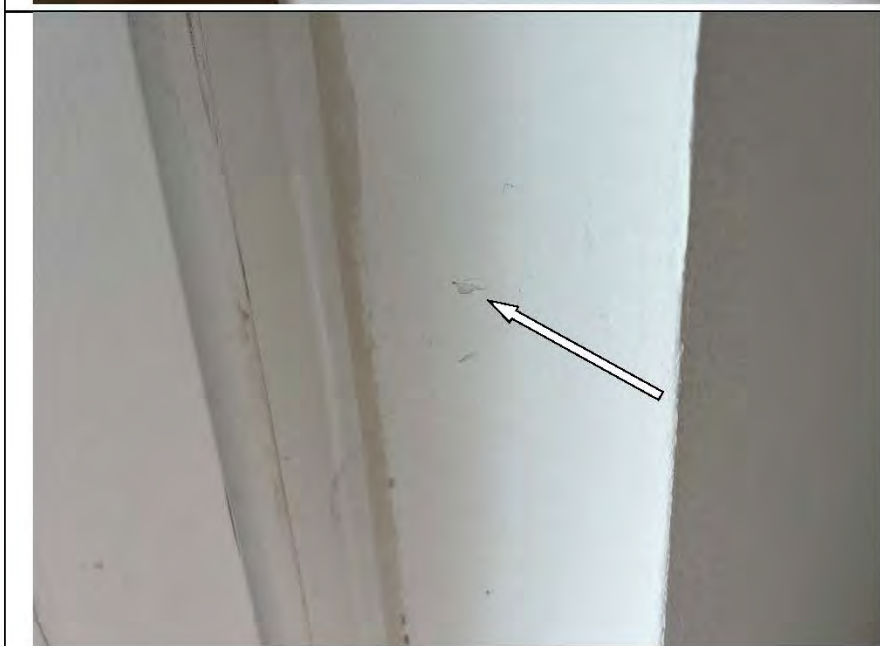
Фото №45. Отслоение краски на откосах оконного блока ПВХ в гостиной.
