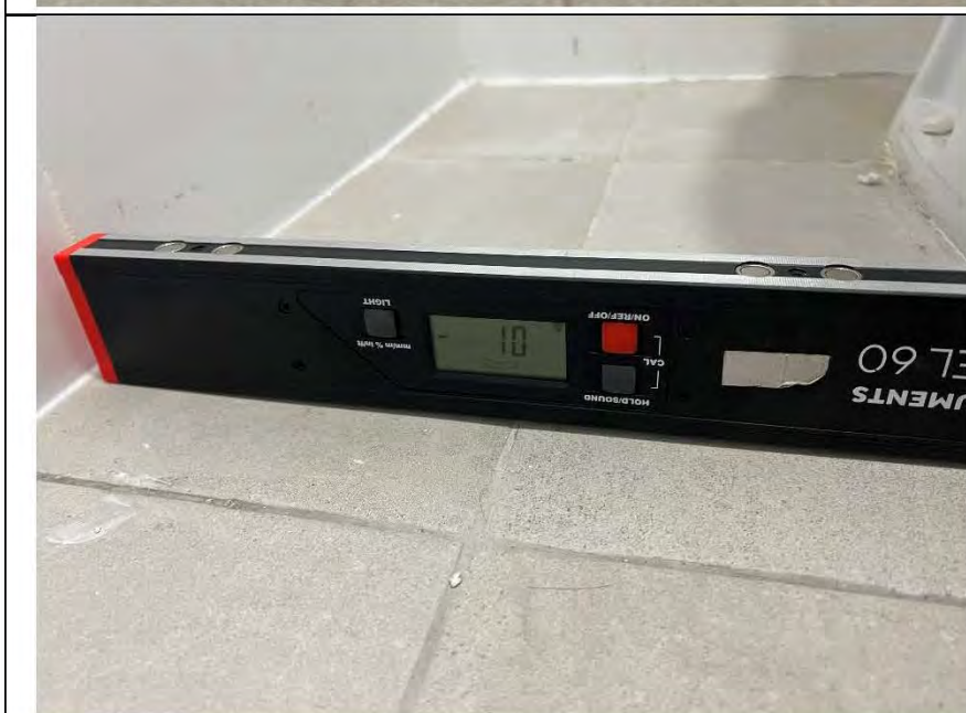
Фото №30. Измерение уровня напольного покрытия в санузле.
