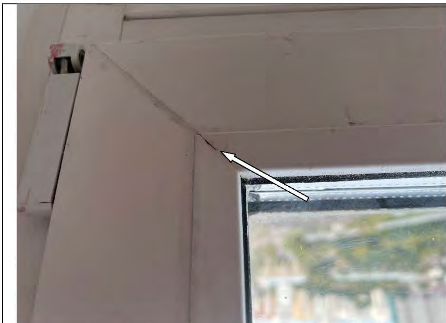
Фото №58. Зазор в стыке профилей ПВХ оконного блока в гостиной.
