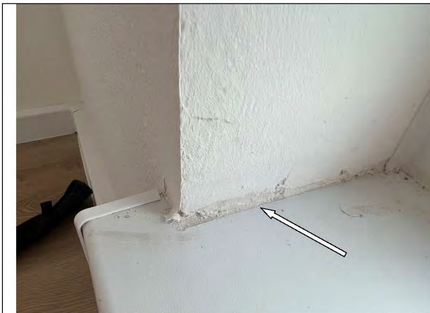
Фото №40. Торец подоконной доски в не заходит за откос в спальне.
