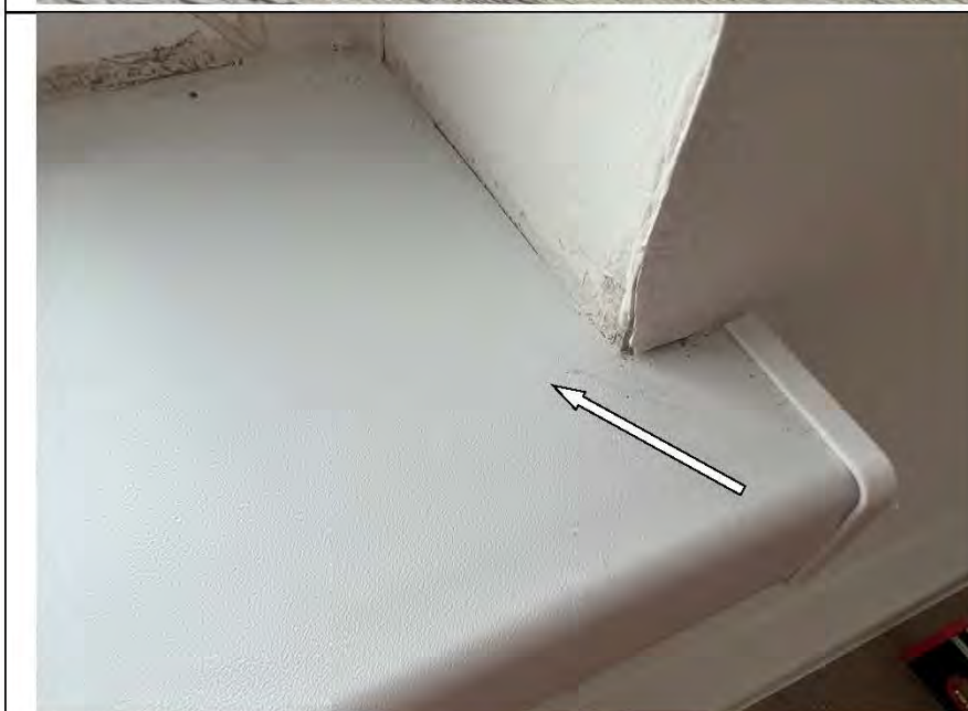
Фото №38. Царапина на лицевой поверхности подоконной доски в спальне.
