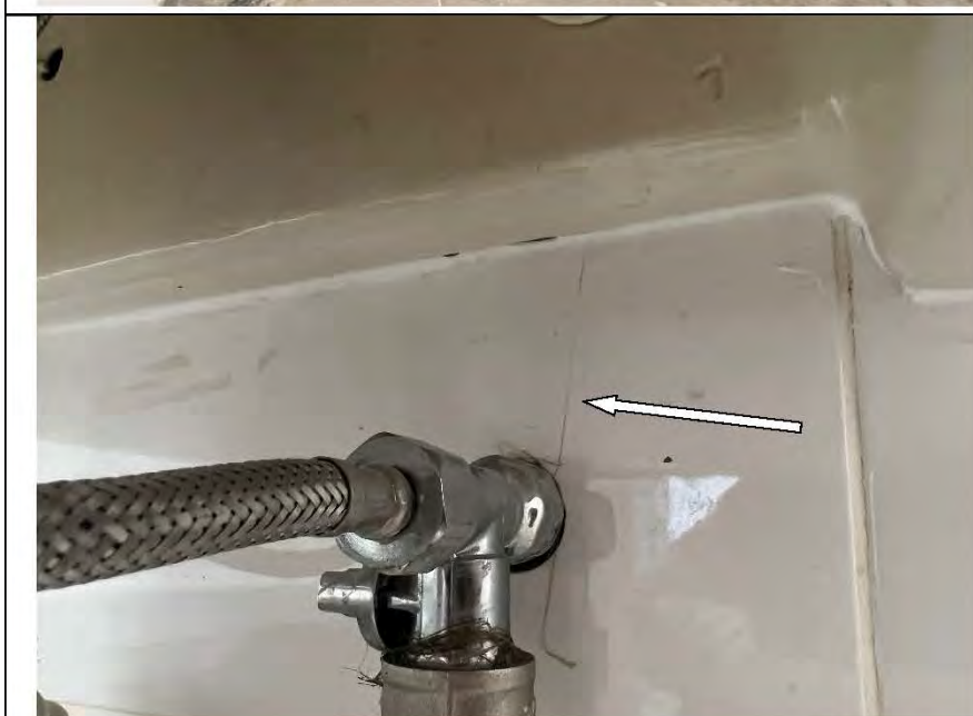
Фото №20. Трещина настенной керамической плитки в ванной комнате.
