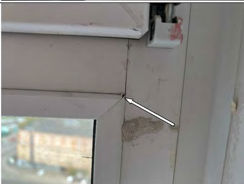
Фото №57. Скол на профиле ПВХ оконного блока в гостиной.
