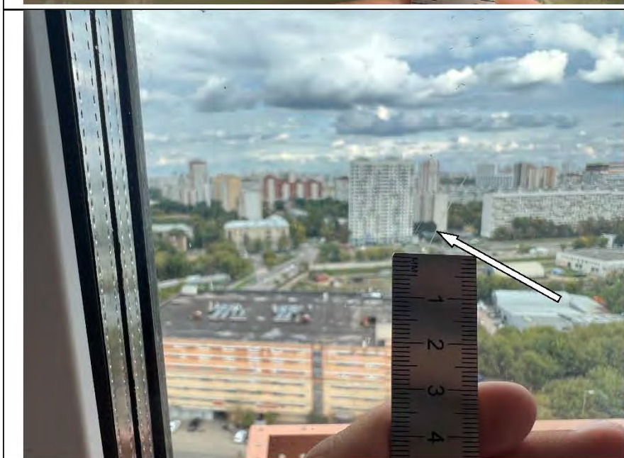
Фото №51. Царапины на стеклопакете оконного блока ПВХ в кухне.
