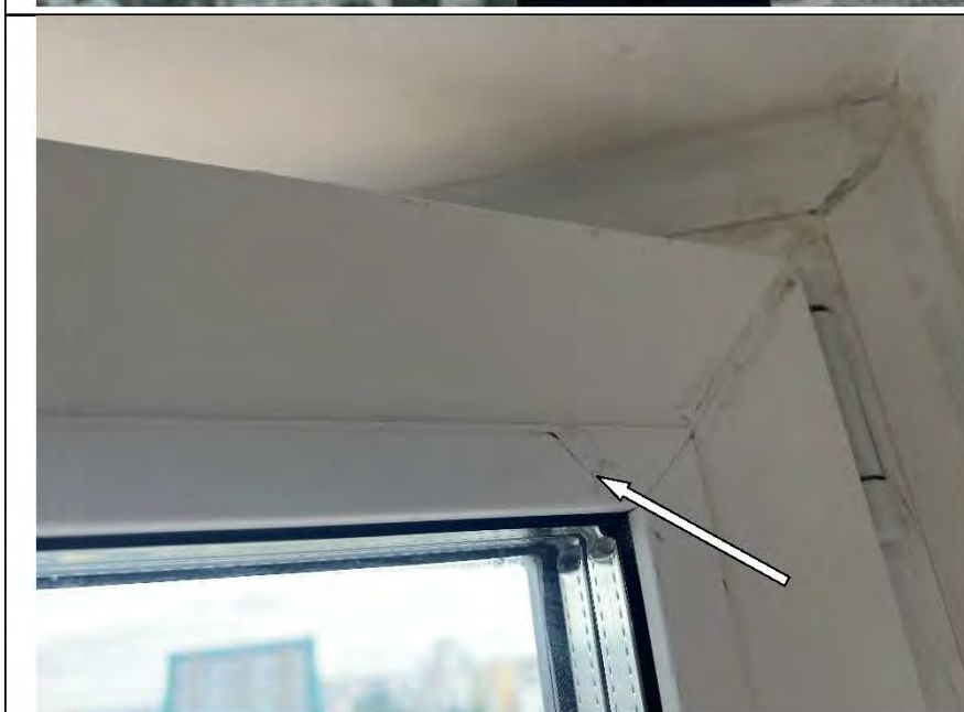
Фото №54. Царапины на профиле ПВХ оконного блока в спальне.
