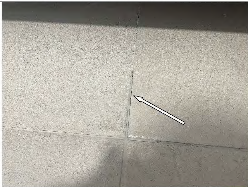
Фото №33. Трещина затирачного раствора в шовном пространстве напольной керамической плитки в ванной комнате.
