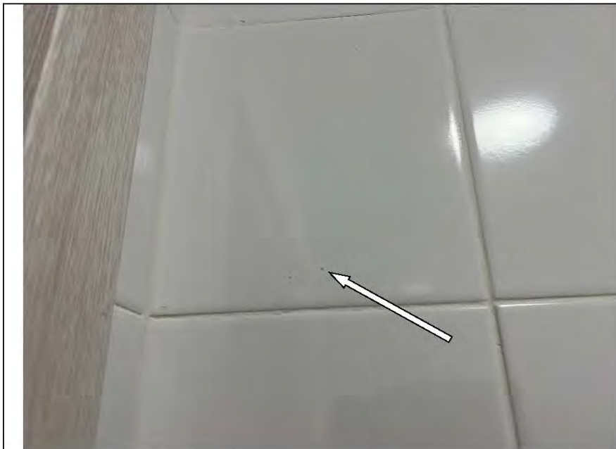
Фото №22. Окарины на настенной керамической плитке в санузле.
