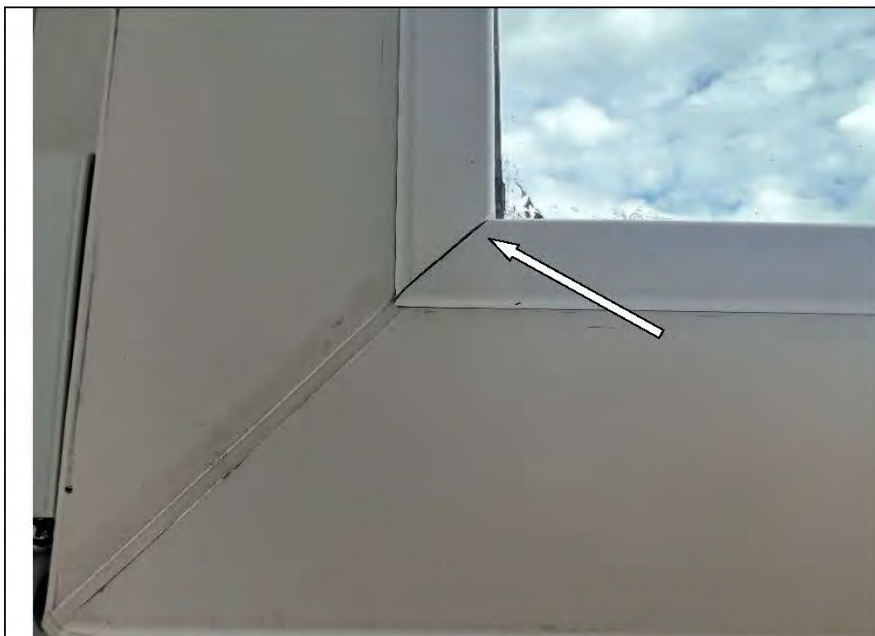
Фото №61. Зазор в стыке профилей ПВХ оконного блока в кухне.
