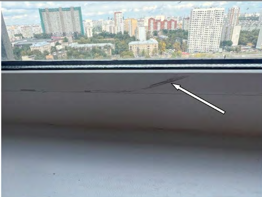
Фото №55. Царапины на профиле ПВХ оконного блока в гостиной.
