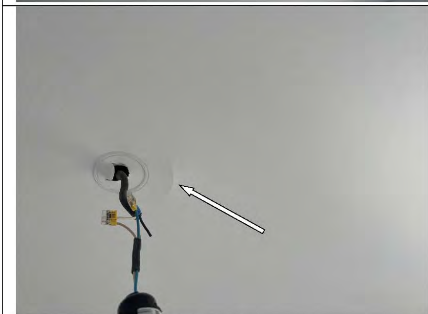
Фото №66. Видимые инженерные сети на поверхности полотна натяжного потолка в гостиной.
