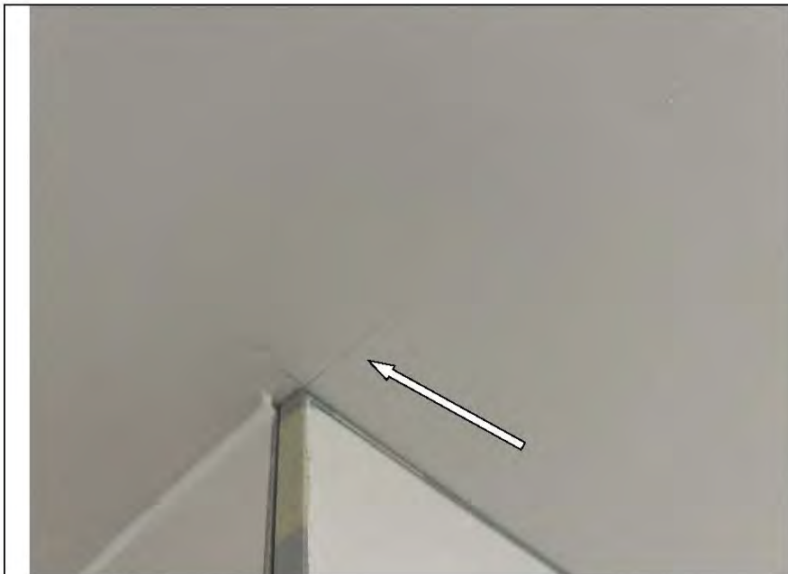
Фото №70. Царапина на лицевой поверхности потолка в ванной комнате.
