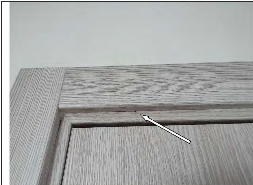
Фото №82. Скол ламинации на коробке деревянного дверного блока в спальне.
