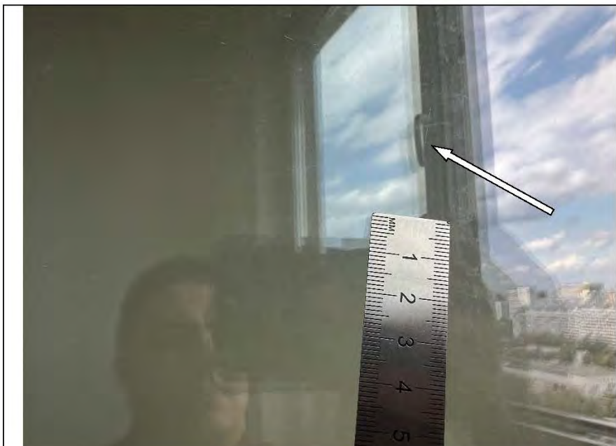
Фото №49. Царапины на стеклопакете оконного блока ПВХ в гостиной.
