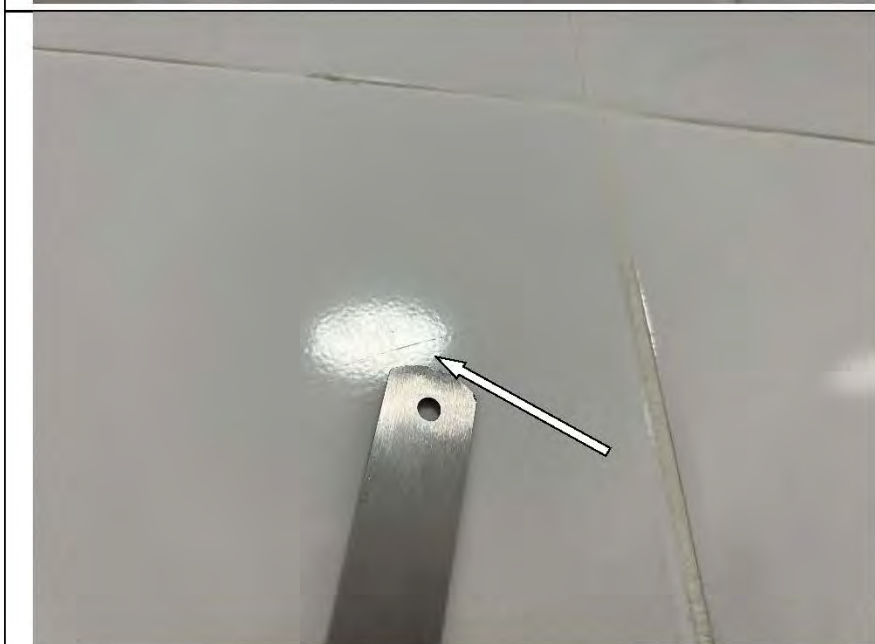
Фото №23. Царапина на настенной керамической плитке в санузле.
