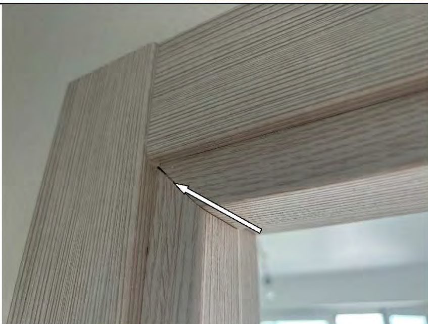
Фото №77. Элементы дверного блока в гостиной соединены не надежно.
