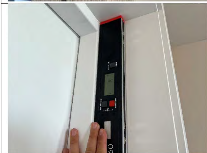
Фото №84. Отклонение короба входного дверного блока от вертикали составляет 4 мм.
