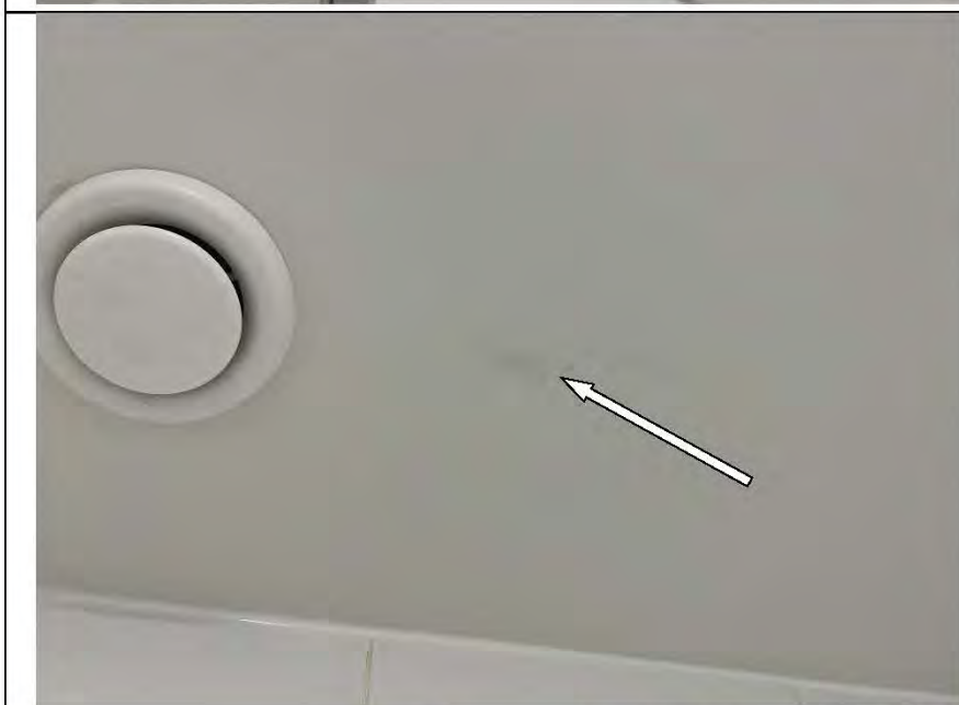
Фото №71. Загрязнение лицевой поверхности потолка в ванной комнате.
