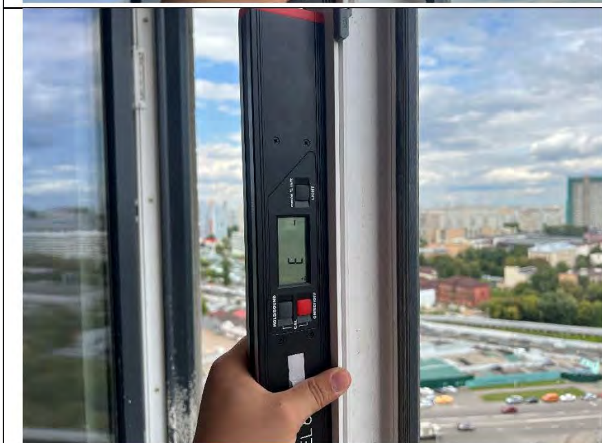
Фото №63. Отклонение оконного блока в гостиной по уровню вертикальности составляет 3 мм.
