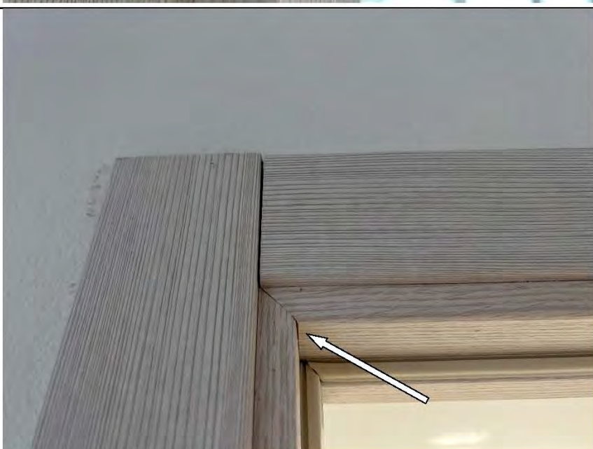
Фото №78. Элементы дверного блока в санузле соединены не надежно.
