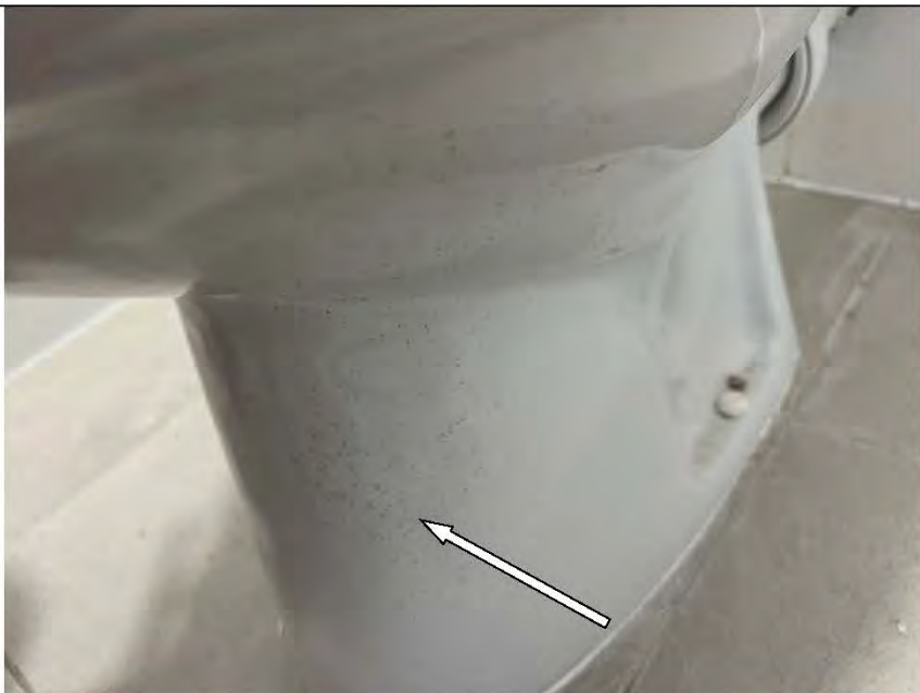
Фото №85. Окалины на унитазе в санузле.
