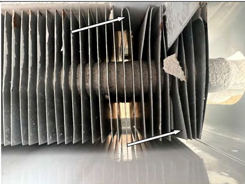
Фото №86. Замятие сот радиатора в спальне.
