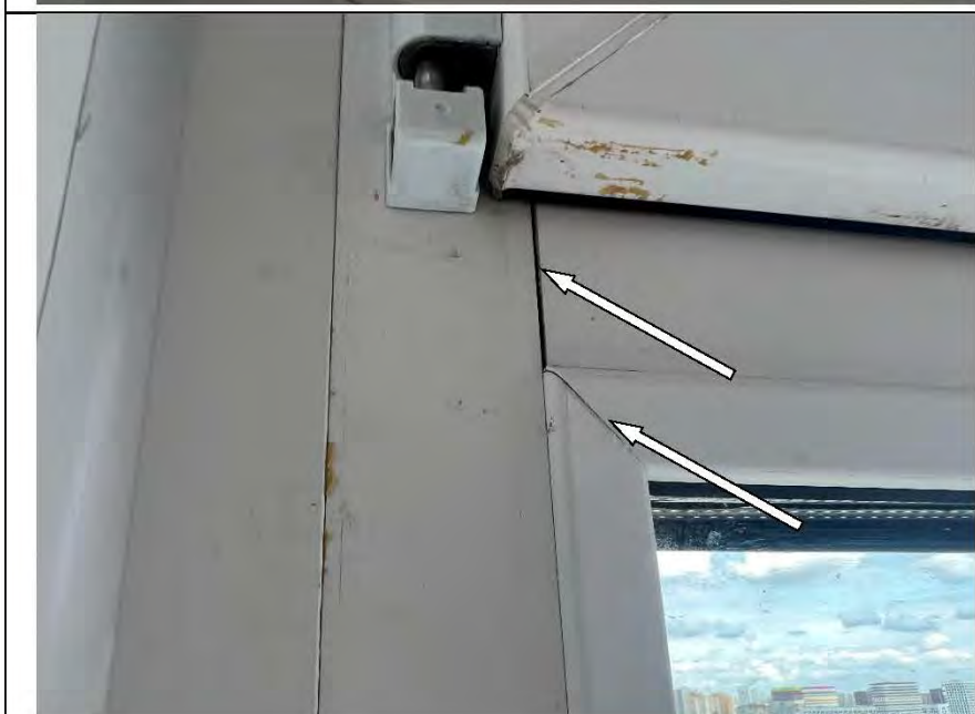
Фото №60. Зазор в стыке профилей ПВХ оконного блока в кухне.
