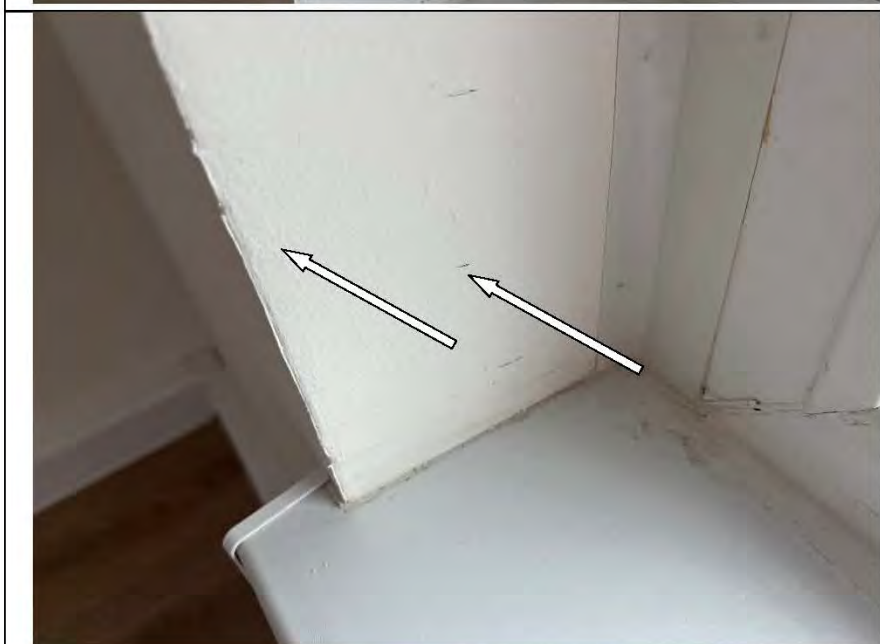
Фото №44. Подтеки краски на откосах оконного блока ПВХ в кухне.
