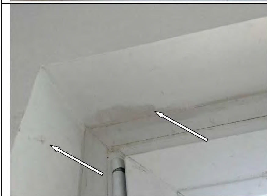
Фото №42. Подтеки краски на откосах оконного блока ПВХ в спальне.
