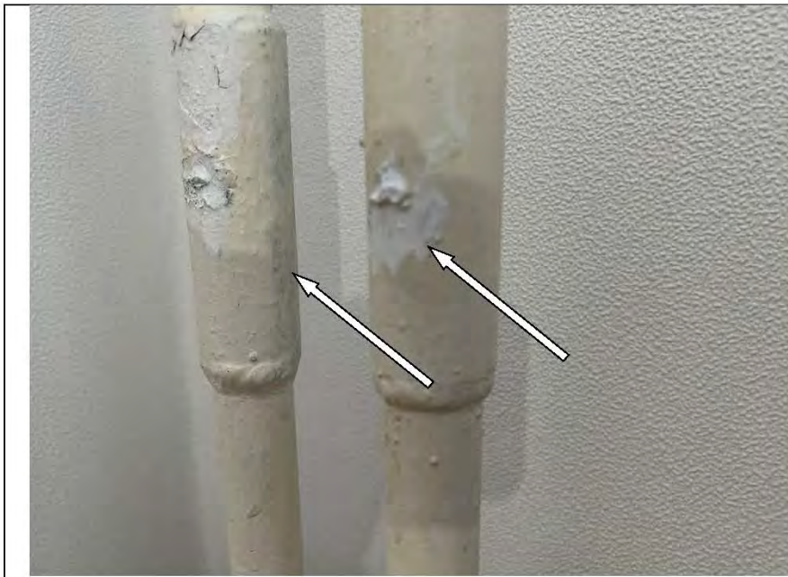
Фото №43. Подтеки краски и не прокрашенные участки труб отопления в кухне.
