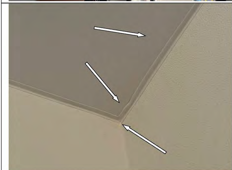
Фото №33. Загрязнение полотна натяжного потолка в прихожей. Зазор в стыках декоративного молдинга в прихожей.
