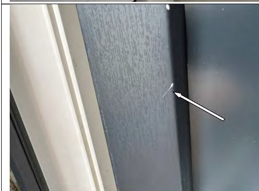
Фото №30. Механические повреждения профиля балконного дверного блока ПВХ в кухне.
