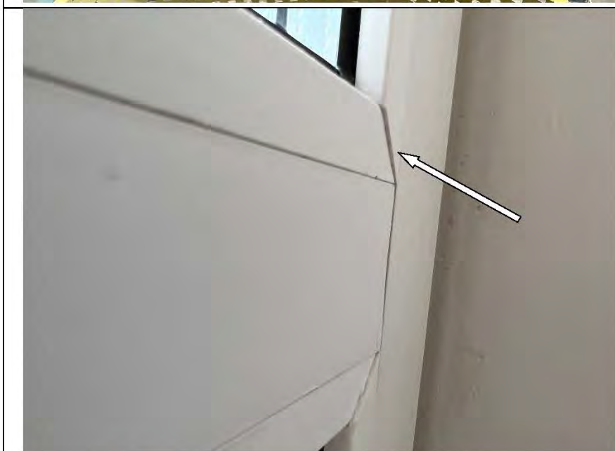
Фото №29. Зазоры в стыках профилей балконного дверного блока ПВХ в кухне.
