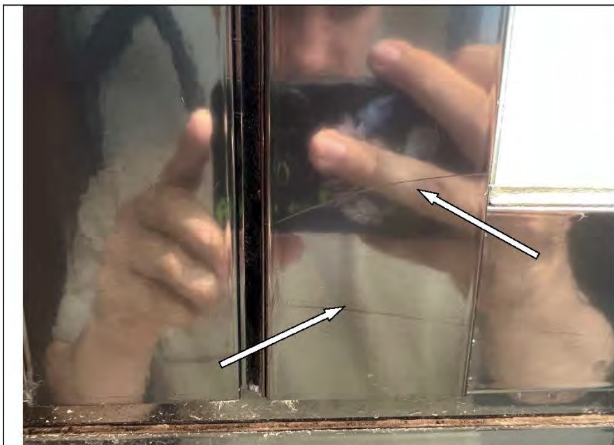
Фото №31. Царапины на металлическом профиле оконного блока на лоджии.
