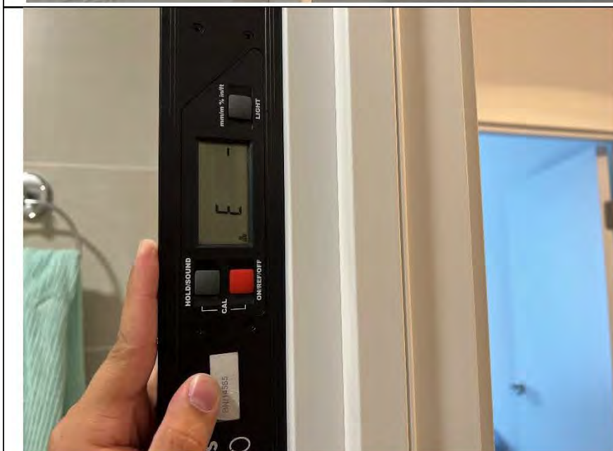
Фото №38. Отклонение коробки от плоскости и прямолинейности дверного блока в ванной комнате равняется 3 мм.
