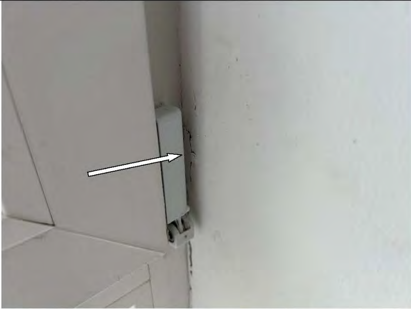
Фото №22. Трещина откоса оконного блока ПВХ в спальне.
