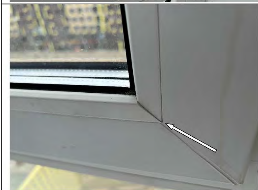
Фото №27. Зазоры в стыках профилей оконного блока ПВХ в спальне.
