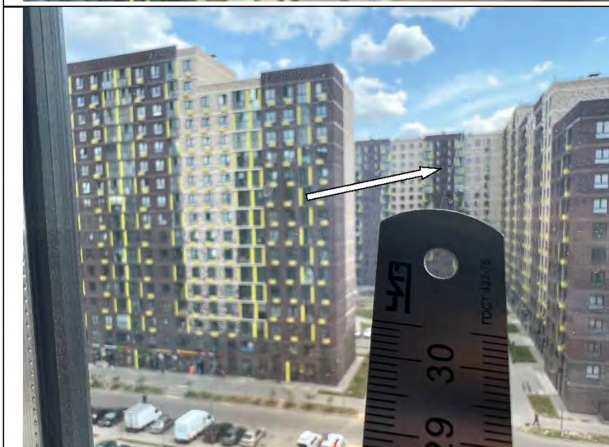
Фото №21. Царапины на стеклопакете оконного блока ПВХ в спальне.
