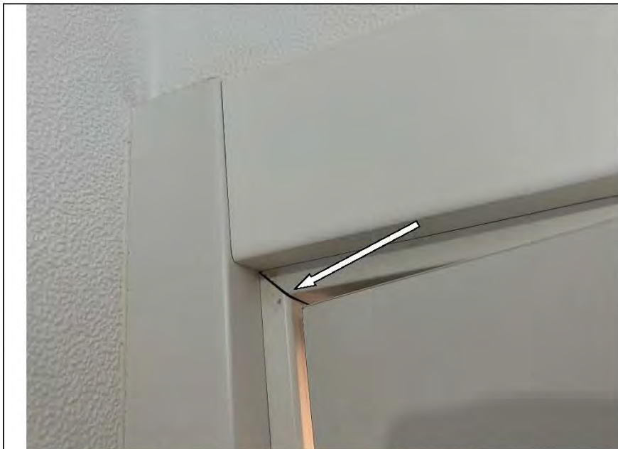
Фото №37. Элементы дверного блока соединены не надежно (коробка) в кухне.
