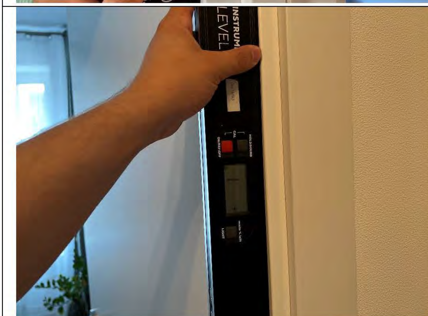
Фото №39. Отклонение коробки от плоскости и прямолинейности дверного блока в спальне равняется 7 мм.
