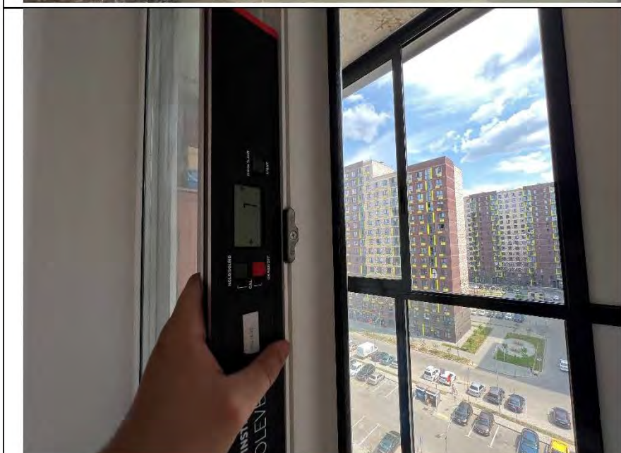
Фото №32. Отклонение балконного дверного блока ПВХ в кухне равняется 7 мм.
