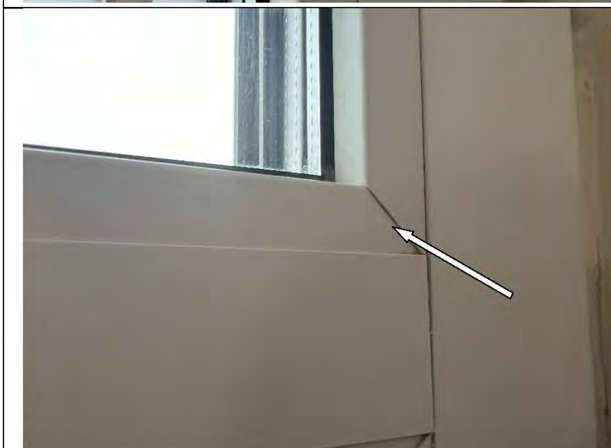
Фото №59. Зазоры в стыках профилей ПВХ оконного блока в кухне.
