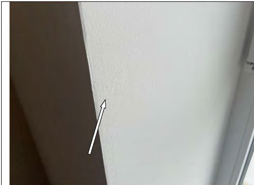
Фото №43. Подтеки краски на откосах оконного блока ПВХ в спальне.
