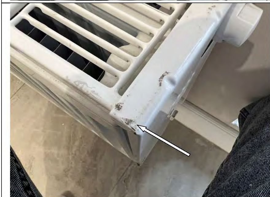
Фото №81. Скол на отопительном приборе в кухне
