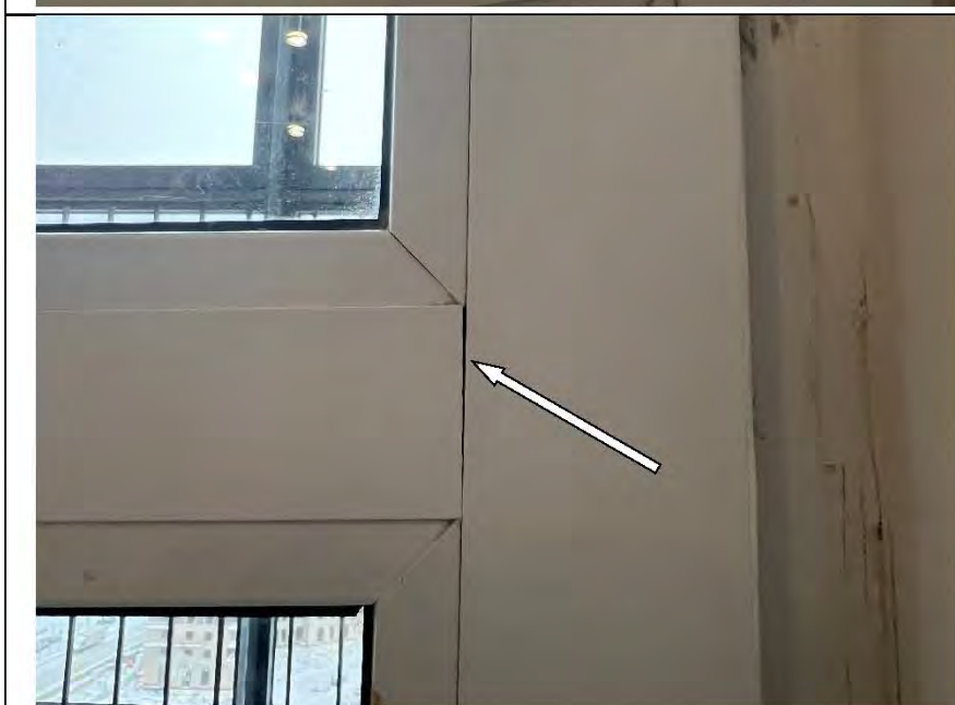
Фото №60. Зазоры в стыках профилей ПВХ дверного блока в кухне.
