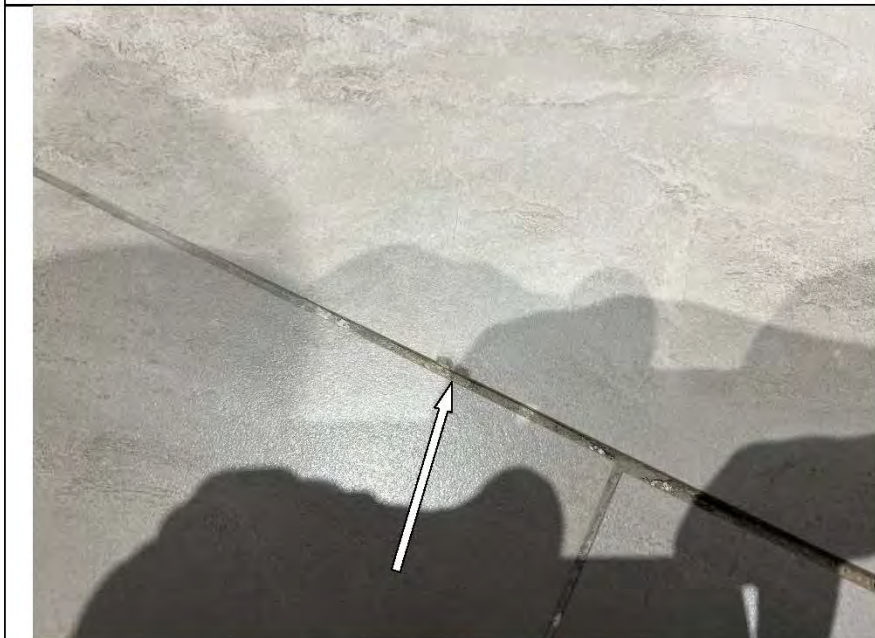
Фото №38. Отбитости напольной керамической плитки в ванной комнате.
