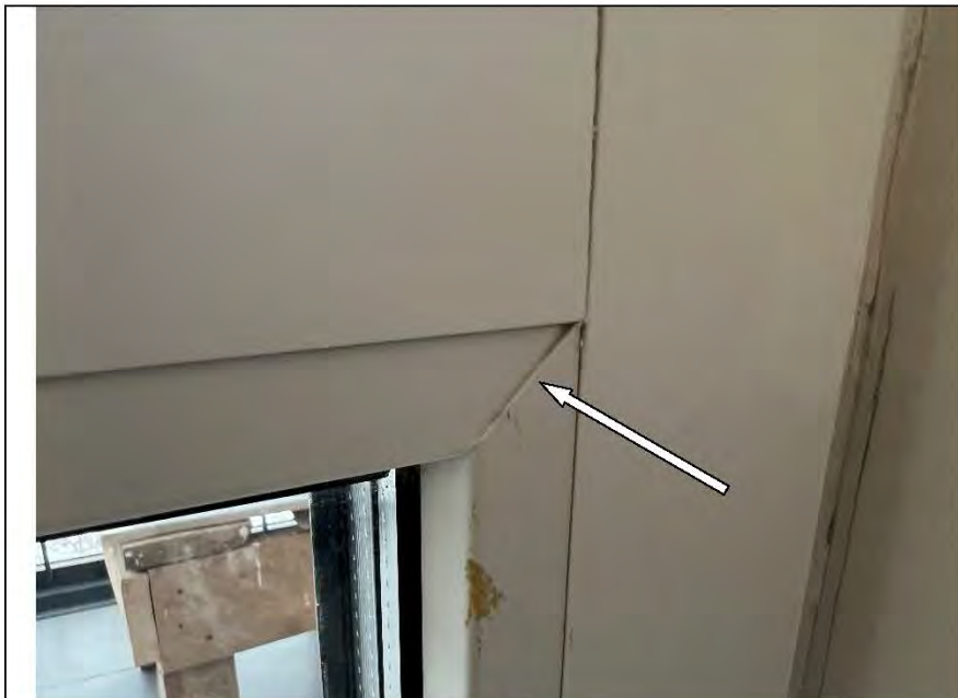
Фото №58. Зазоры в стыках профилей ПВХ оконного блока в кухне.
