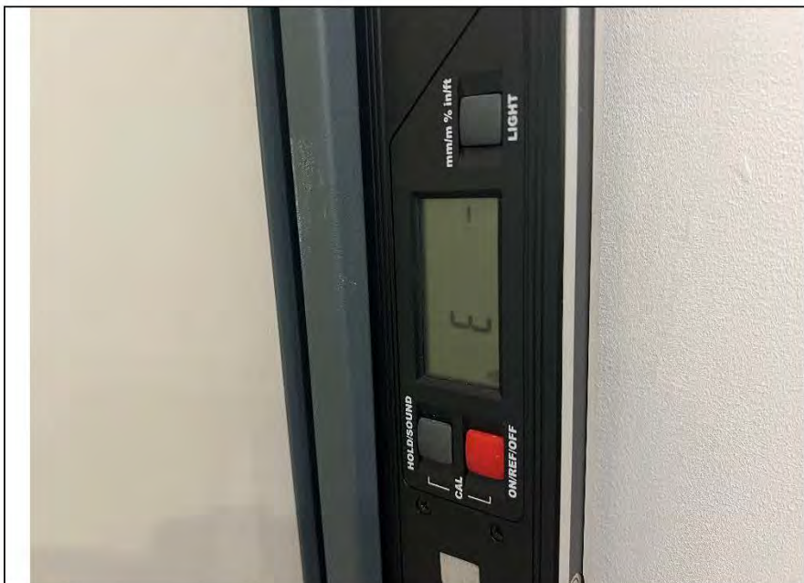
Фото №79. Отклонение коробки входного дверного блока по уровню вертикальности составляет 3 мм.
