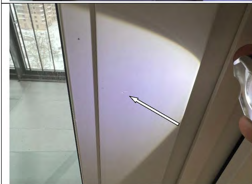
Фото №63. Царапина на профиле ПВХ оконного блока в кухне.
