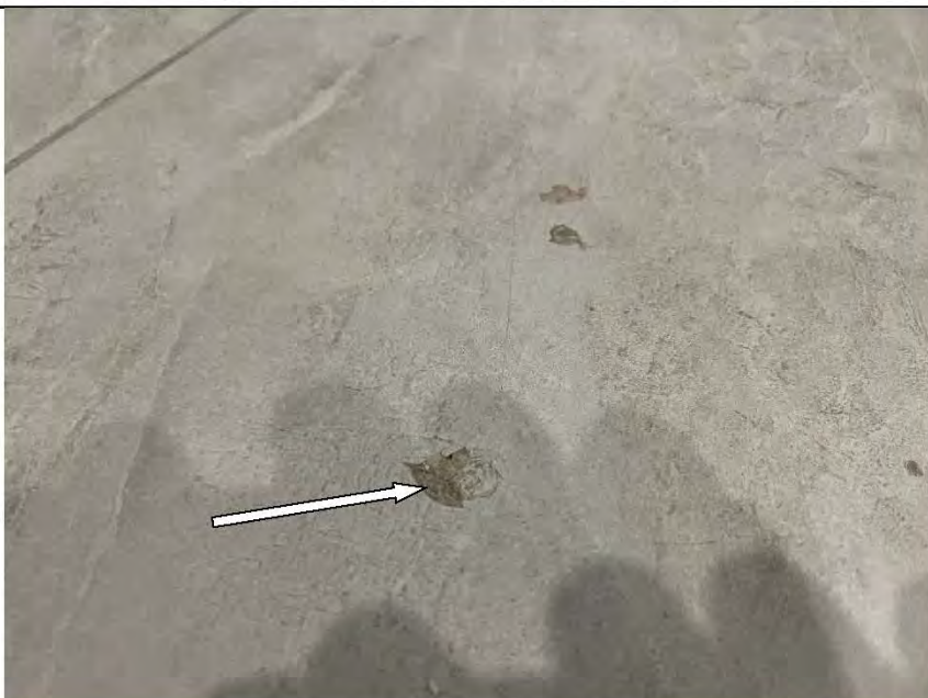
Фото №36. Отбитости напольной керамической плитки в коридоре.
