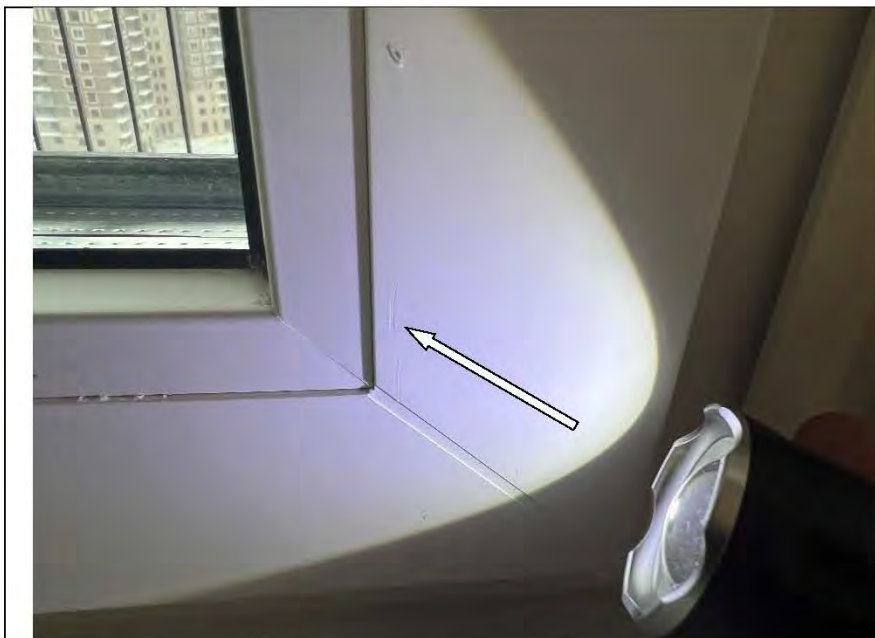
Фото №64. Царапина на профиле ПВХ оконного блока в кухне.
