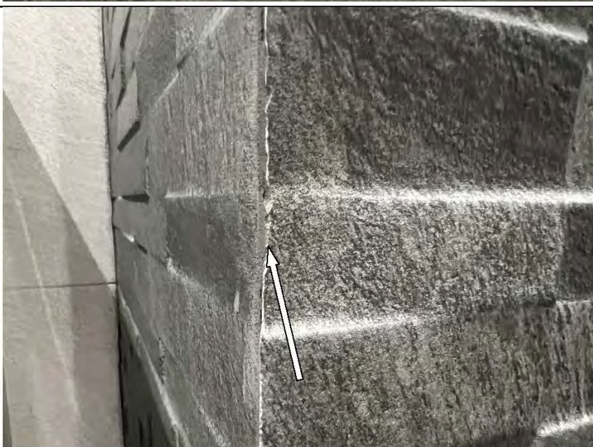
Фото №24. Скол настенной керамической плитки в ванной комнате.
