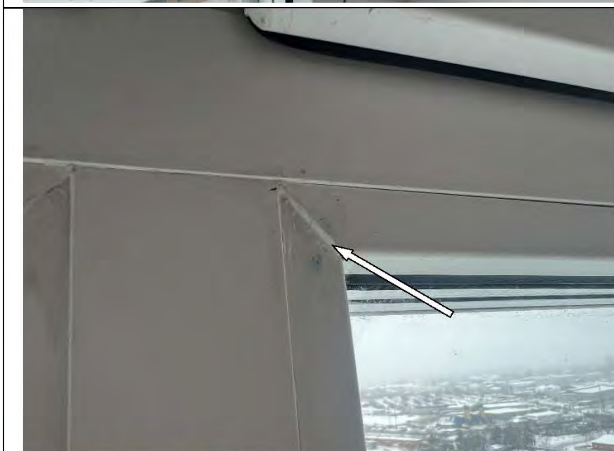
Фото №56. Зазоры в стыках профилей ПВХ оконного блока в спальне.
