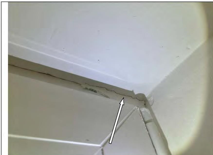
Фото №46. Трещина по откосу оконного блока ПВХ в кухне.
