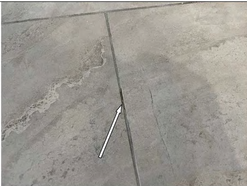
Фото №31. Неполное заполнение шовного пространства напольной керамической плитки в кухне.
