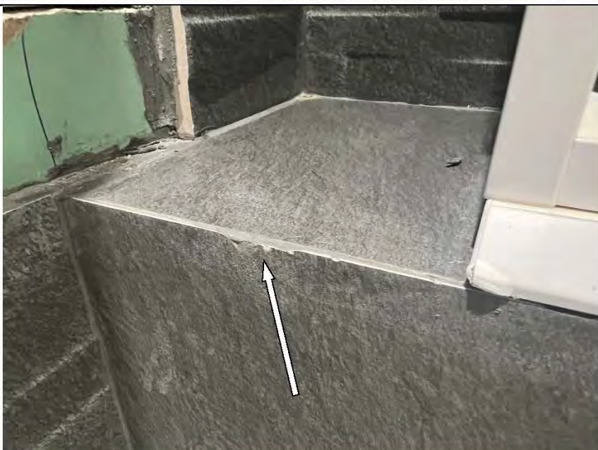
Фото №23. Скол настенной керамической плитки в ванной комнате.
