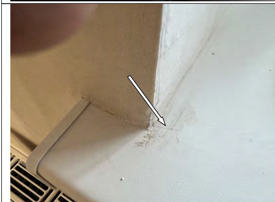
Фото №42. Царапина на лицевой поверхности подоконной доски в кухне.
