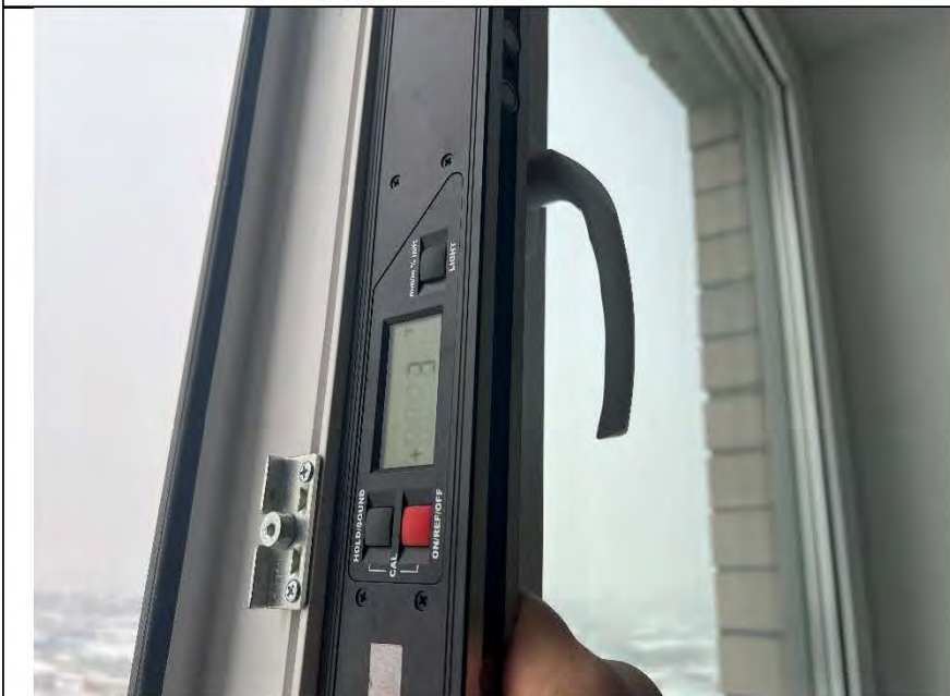
Фото №69. Отклонение оконного блока ПВХ в спальне по уровню вертикальности составляет 3 мм.
