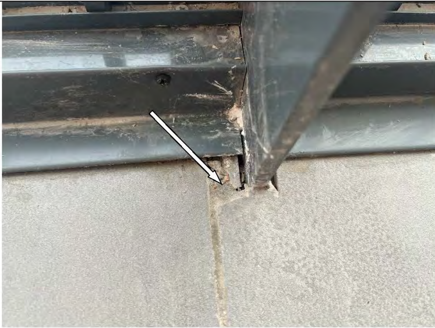
Фото №34. Отбитости напольной керамической плитки на балконе.
