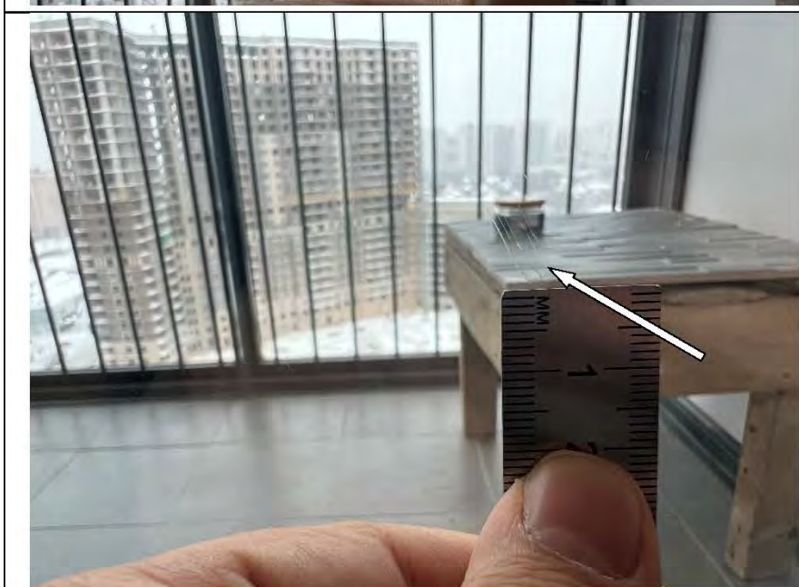
Фото №54. Царапины на стеклопакете оконного блока ПВХ в кухне.
