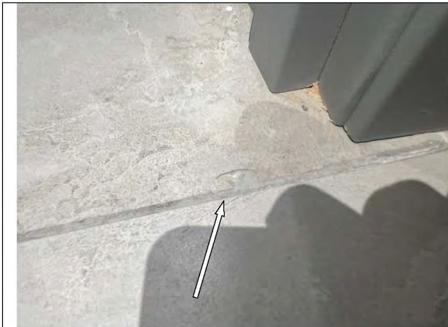
Фото №40. Отбитости напольной керамической плитки в гардеробной.
