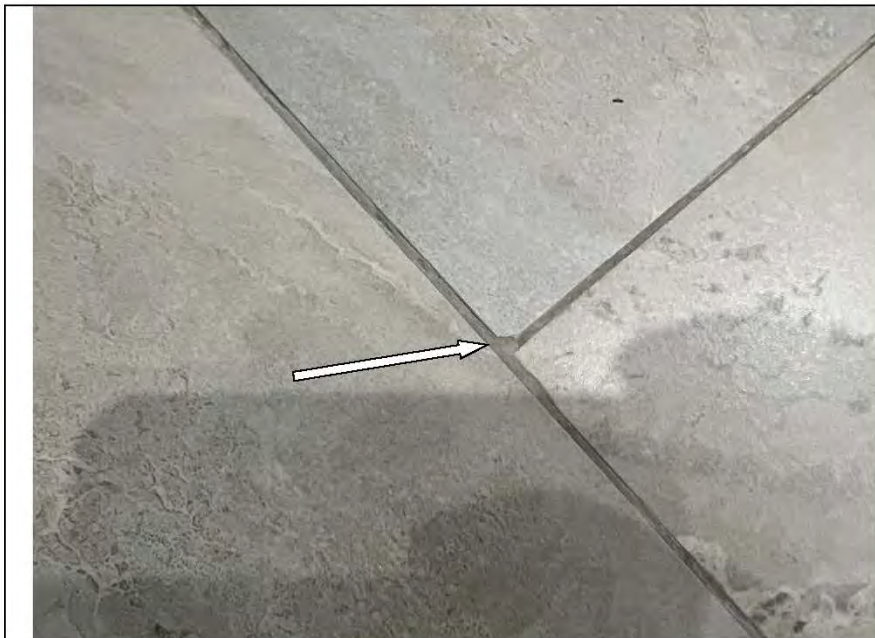
Фото №37. Отбитости напольной керамической плитки в коридоре.
