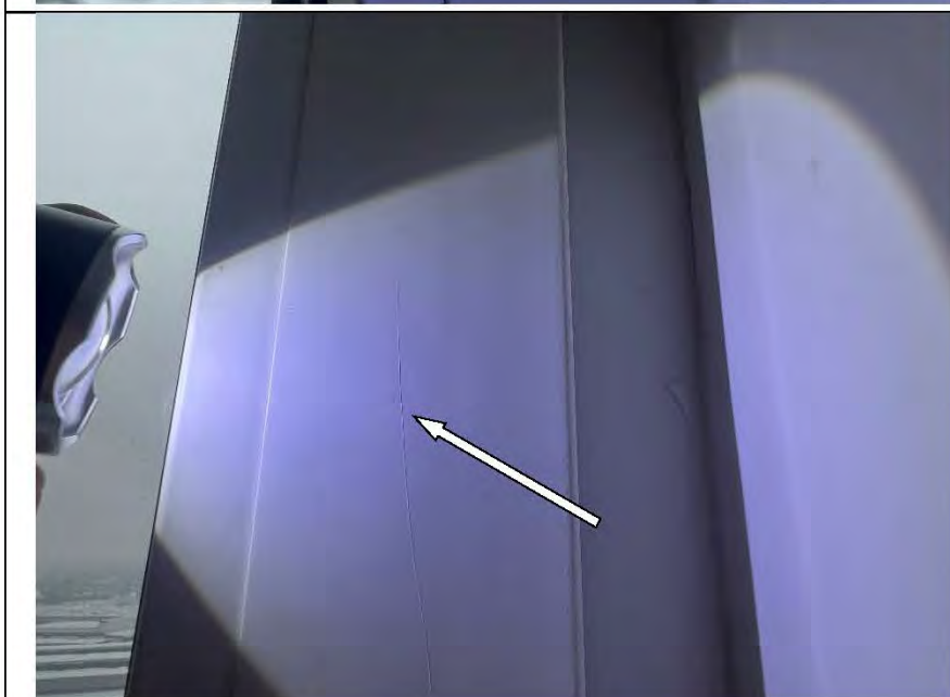
Фото №62. Царапина на профиле ПВХ оконного блока в спальне.
