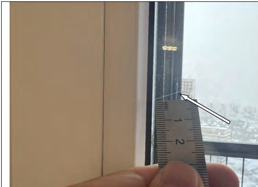
Фото №52. Царапины на стеклопакете оконного блока ПВХ в кухне.
