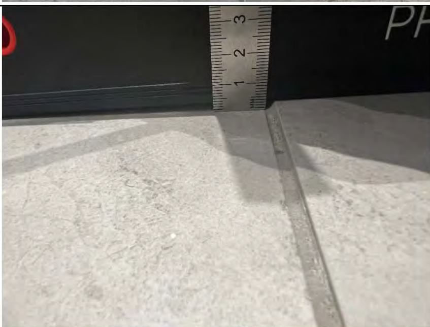
Фото №32. Уступы керамической плитки пола в ванной комнате равно 2 мм.
