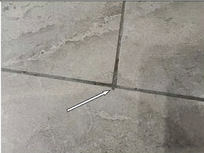
Фото №35. Отбитости напольной керамической плитки в кухне.
