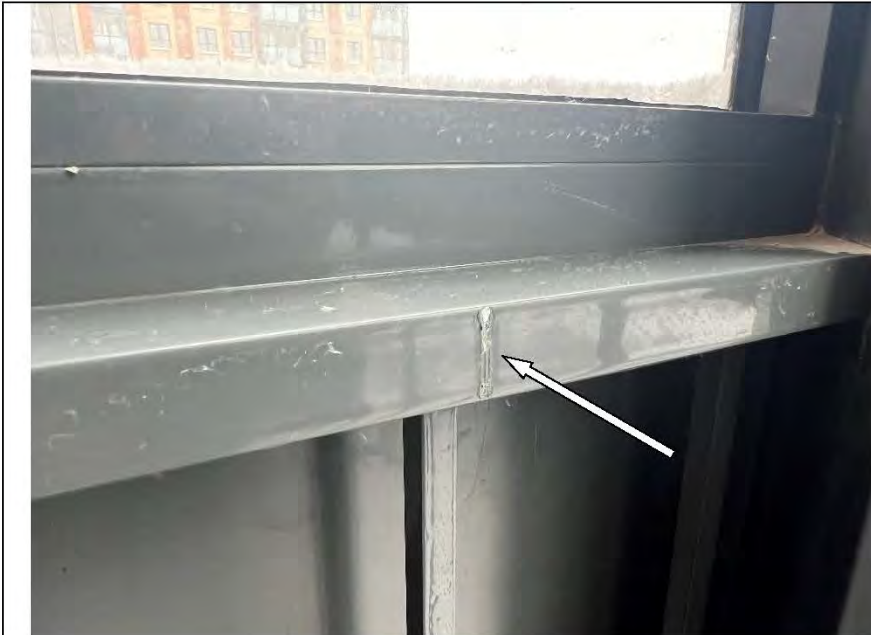
Фото №67. Царапина на металлическом профиле ограждения балкона.
