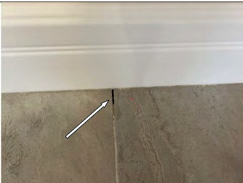
Фото №30. Неполное заполнение шовного пространства напольной керамической плитки в кухне.
