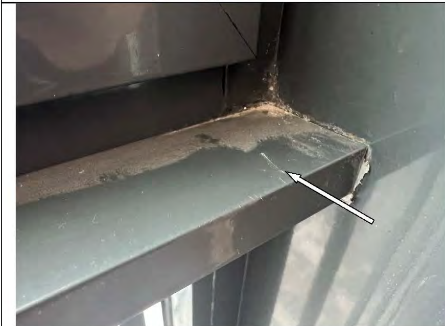
Фото №68. Царапина на металлическом профиле ограждения балкона.
