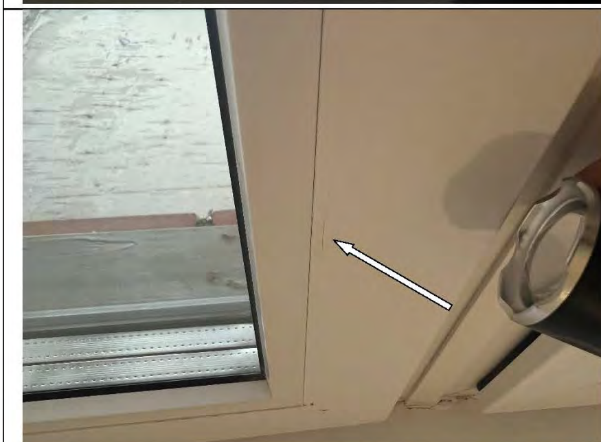
Фото №65. Царапина на профиле ПВХ дверного блока в кухне.
