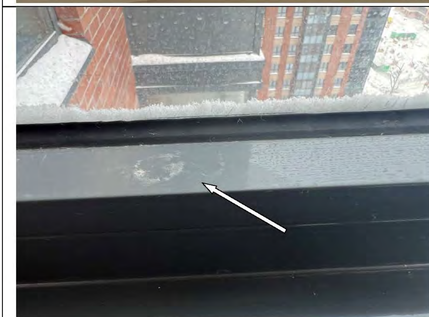
Фото №66. Царапина на металлическом профиле оконного блока на балконе.
