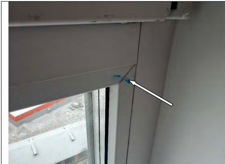
Фото №55. Зазоры в стыках профилей ПВХ оконного блока в спальне.
