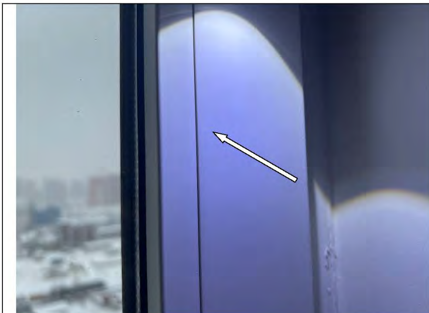
Фото №61. Царапина на профиле ПВХ оконного блока в спальне.
