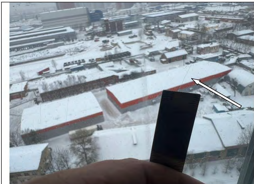
Фото №49. Царапины на стеклопакете оконного блока ПВХ в спальне.
