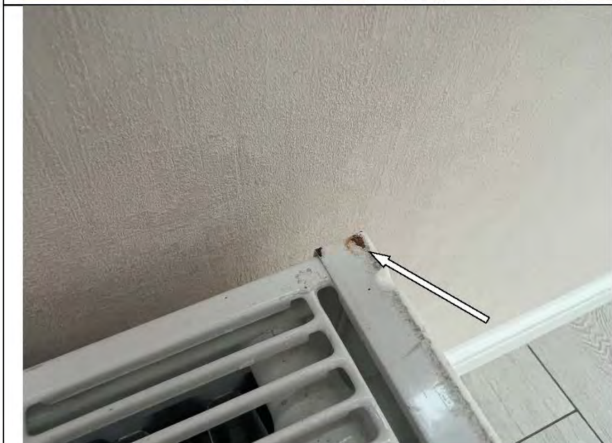
Фото №80. Скол на отопительном приборе в спальне.
