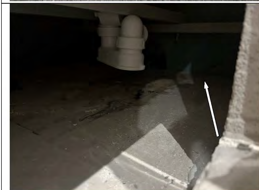
Фото №26. Частично отсутствует керамическая плитка за ванной.
