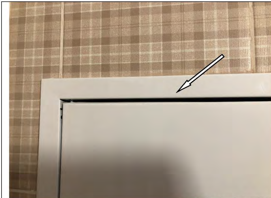
Фото №52. Неровный сантехнический люк в ванной комнате в квартире.
