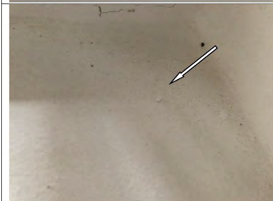
Фото №39. Неровности, сколы на окрашенных откосах оконного блока ПВХ в кухне в квартире.
