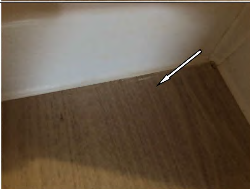
Фото №66. Прогиб ламината в коридоре в квартире.
