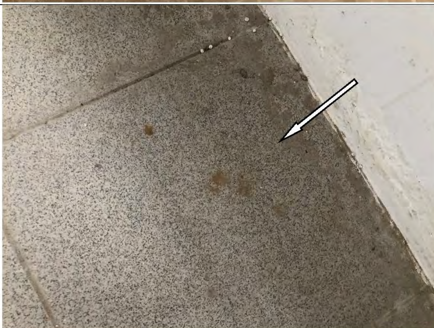
Фото №57. Загрязнение напольной керамической плитки на лоджии в квартире.
