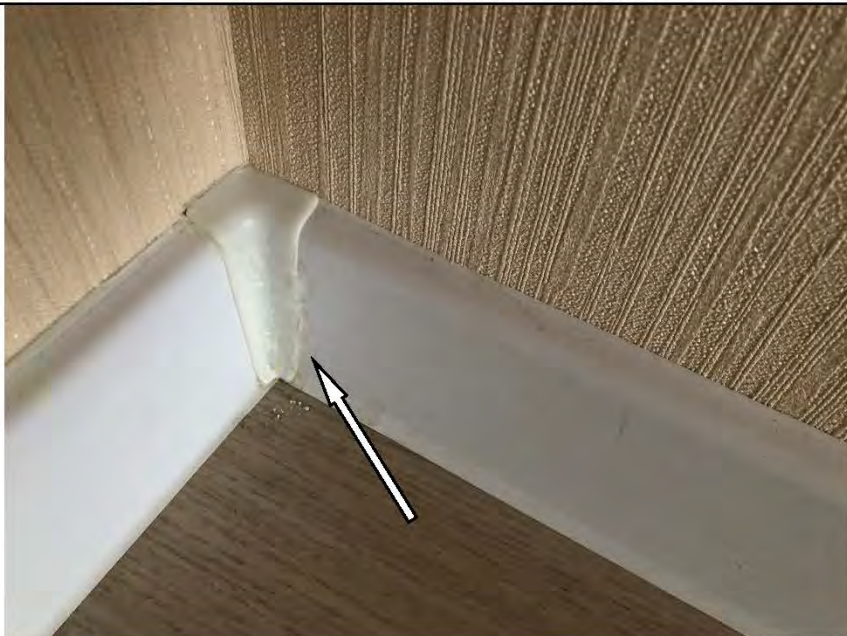
Фото №20. Загрязнение плинтуса ПВХ в детской в квартире.
