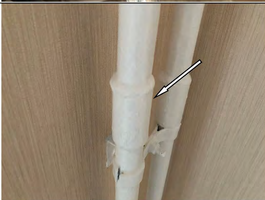
Фото №44. Неровности, сколы на окрашенных трубах отопления в спальне в квартире.
