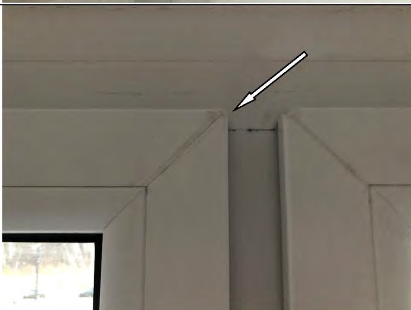
Фото №32. Загрязнение профиля оконного блока ПВХ в детской в квартире.
