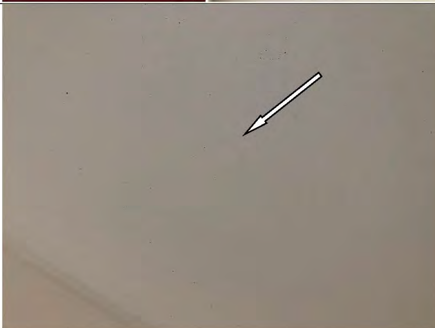
Фото №69. Неровности, сколы на окрашенном потолке на лоджии в квартире.
