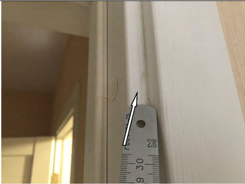
Фото №16. Загрязнение коробки деревянного дверного блока в детской в квартире.
