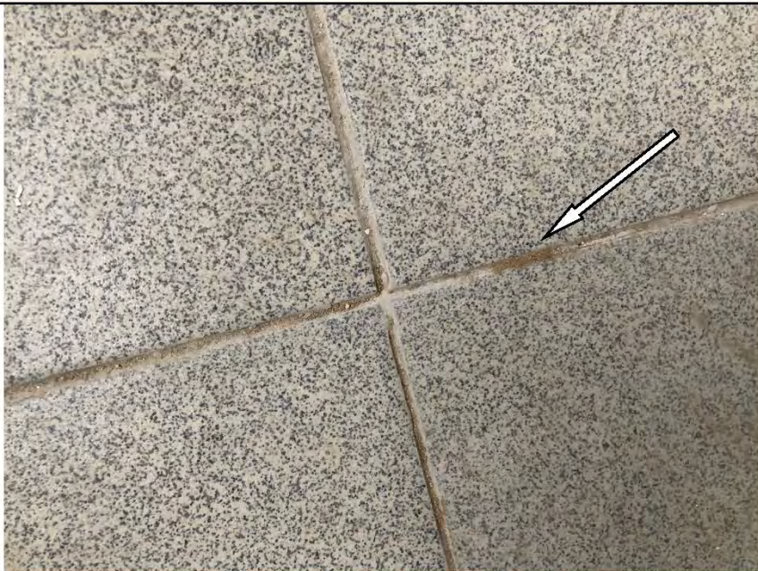
Фото №59. Неровный шов напольной керамической плитки на лоджии в квартире.
