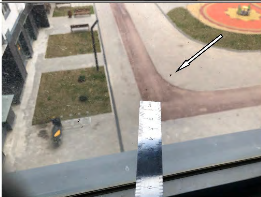
Фото №51. Окарины на стеклопакете оконного блока ПВХ на лоджии в квартире.
