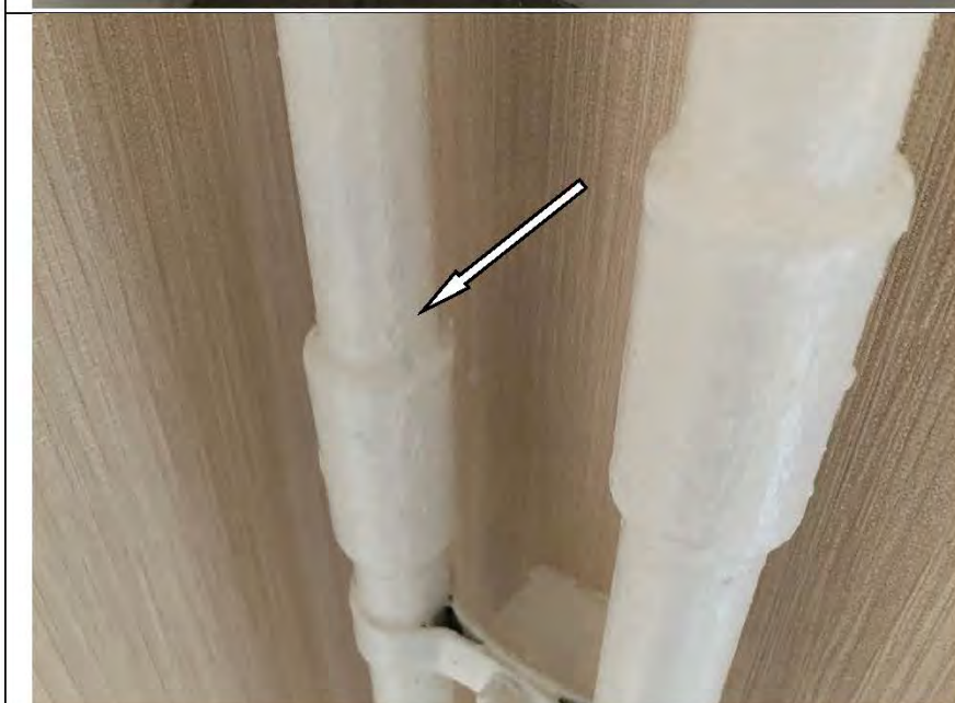
Фото №42. Неровности, сколы на окрашенных трубах отопления в детской в квартире.
