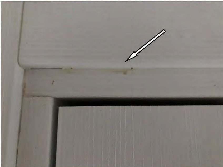
Фото №17. Загрязнение коробки деревянного дверного блока в ванной комнате в квартире.
