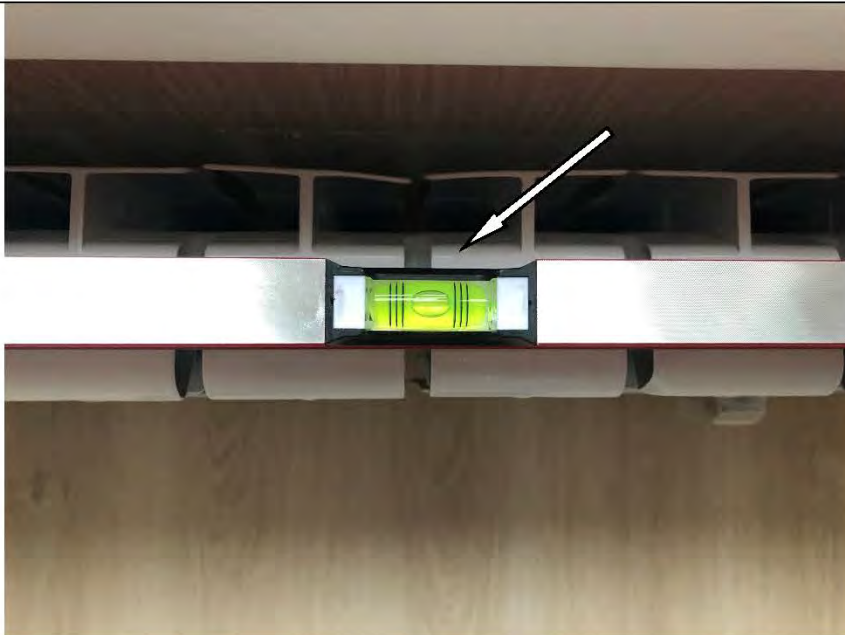
Фото №46. Неровно смонтирован отопительный прибор в детской в квартире.
