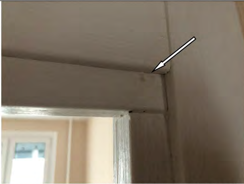
Фото №19. Загрязнение коробки деревянного дверного блока в кухне в квартире.
