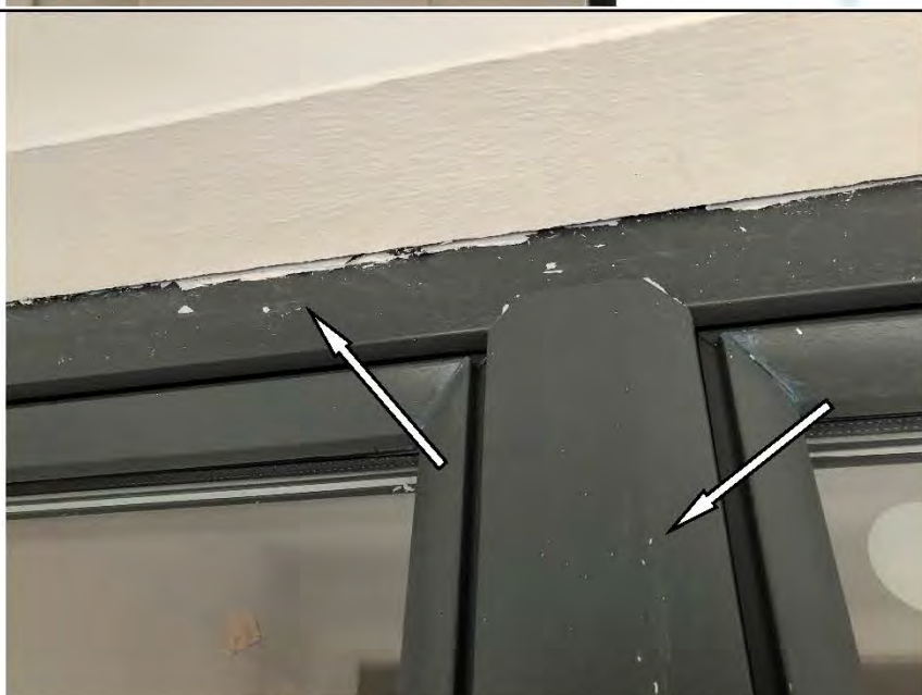
Фото №35. Загрязнение профиля оконного блока ПВХ на лоджии в квартире.
