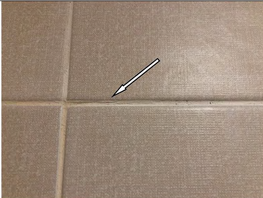
Фото №55. Неровный шов настенной керамической плитки в санузле в квартире.
