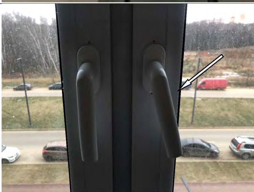
Фото №36. Не отрегулирована фурнитура оконного блока ПВХ в детской в квартире.
