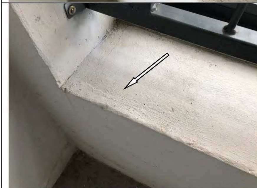
Фото №41. Неровности, сколы на окрашенных откосах оконного блока ПВХ на лоджии в квартире.
