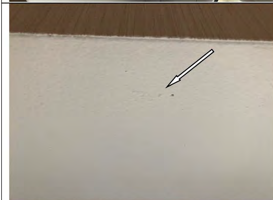
Фото №38. Неровности, сколы на окрашенных откосах оконного блока ПВХ в спальне в квартире.
