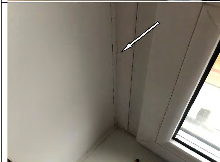
Фото №30. Инфильтрация оконного блока ПВХ в детской в квартире.
