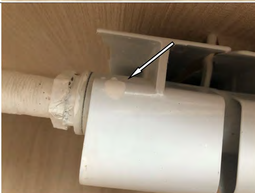
Фото №48. Загрязнение кожуха отопительного прибора в детской в квартире.
