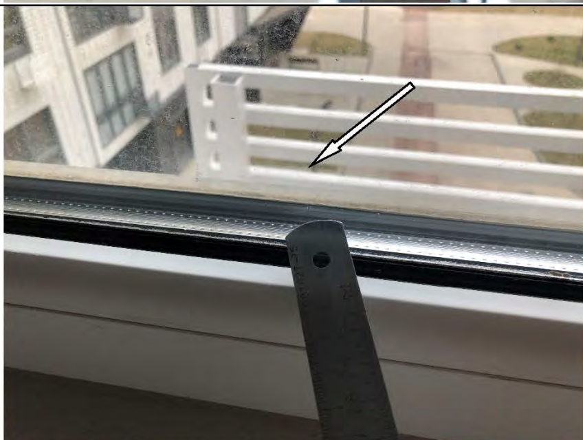
Фото №50. Царапины на стеклопакете оконного блока ПВХ в спальне в квартире.
