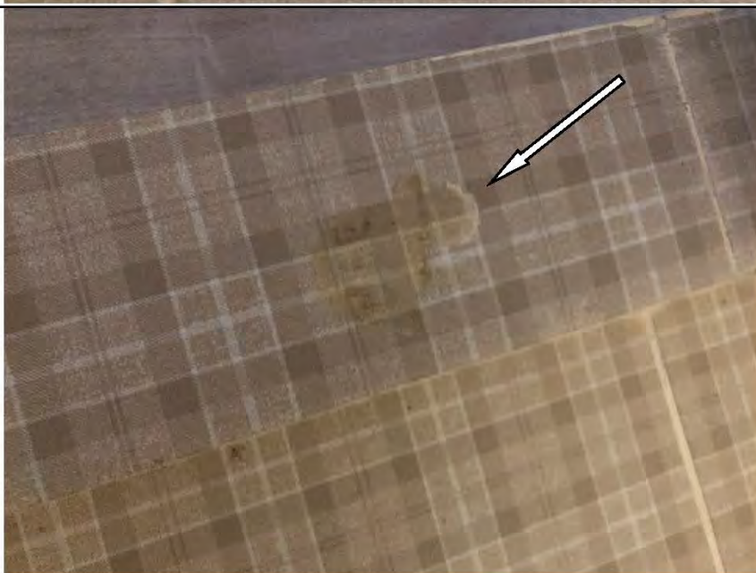
Фото №56. Загрязнение напольной керамической плитки в ванной комнате в квартире.
