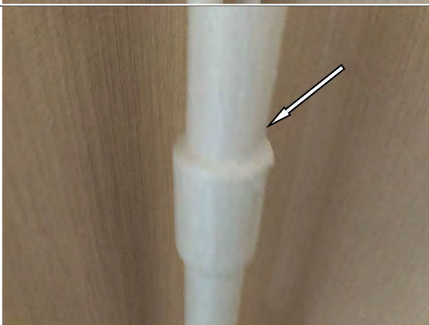
Фото №45. Неровности, сколы на окрашенных трубах отопления в кухне в квартире.
