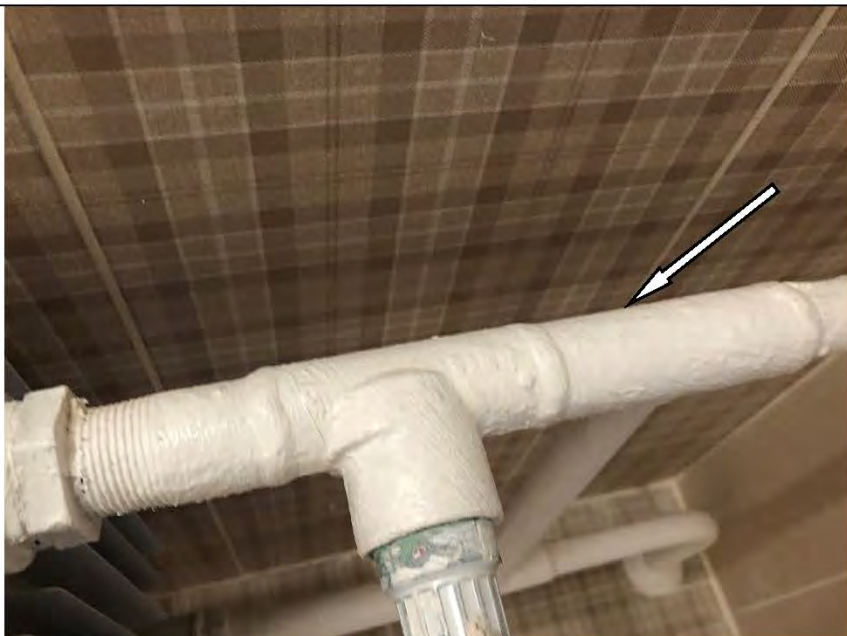
Фото №43. Неровности, сколы на окрашенных трубах отопления в ванной комнате в квартире.
