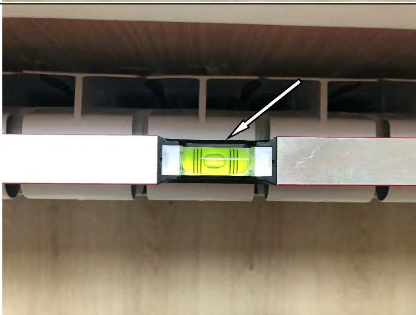
Фото №47. Неровно смонтирован отопительный прибор в спальне в квартире.
