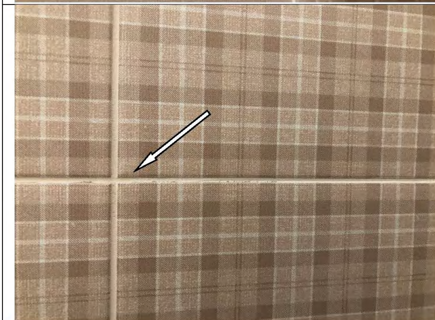
Фото №54. Неровный шов настенной керамической плитки в ванной комнате в квартире.
