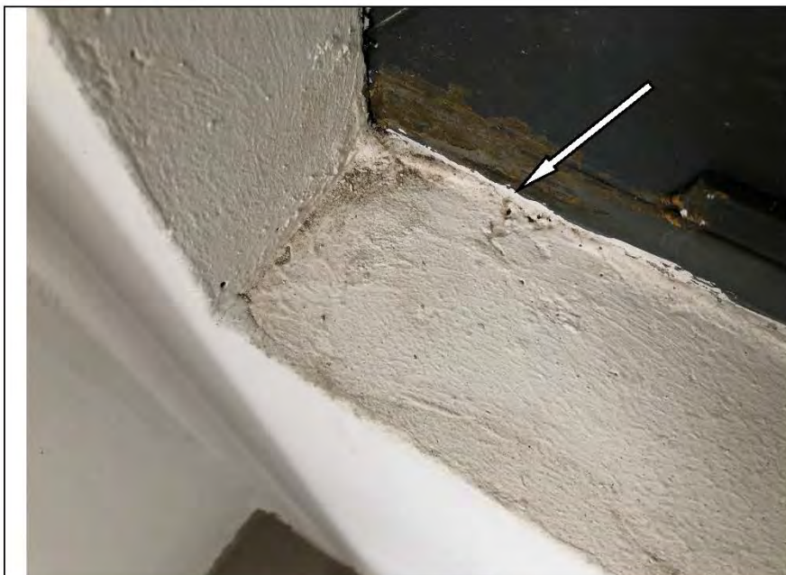
Фото №40. Неровности, сколы на окрашенных откосах оконного блока ПВХ на лоджии в квартире.
