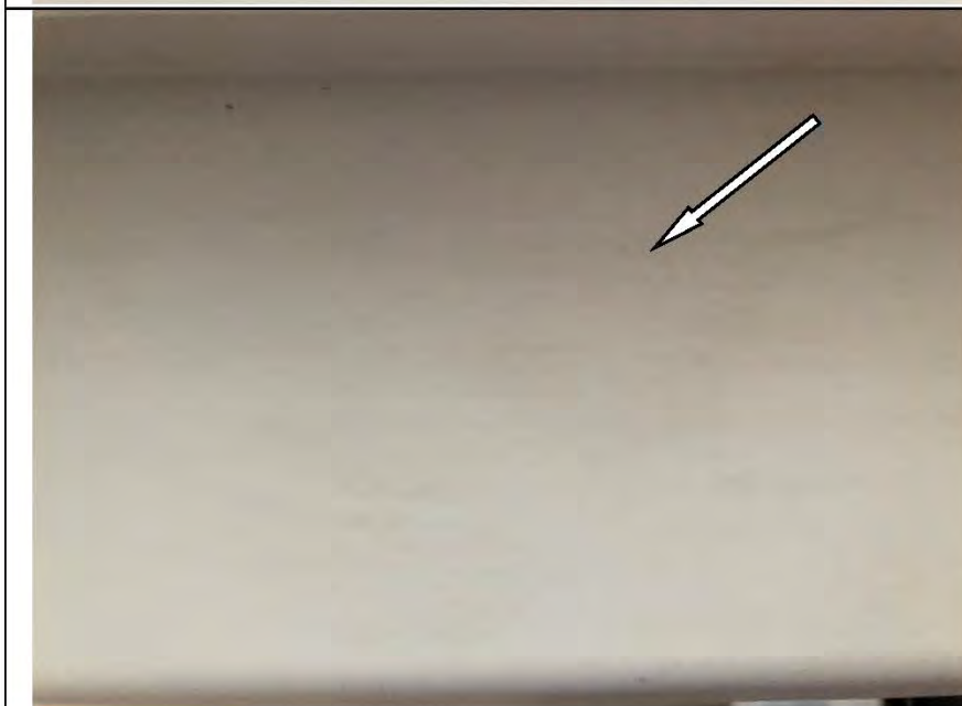
Фото №29. Царапина на подоконной доске в кухне в квартире.
