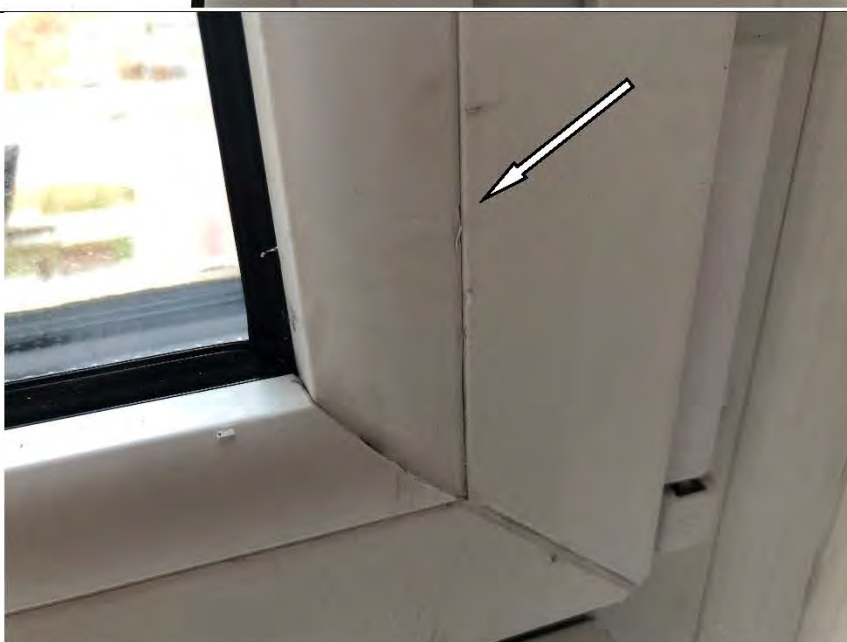
Фото №33. Загрязнение профиля оконного блока ПВХ в спальне в квартире.
