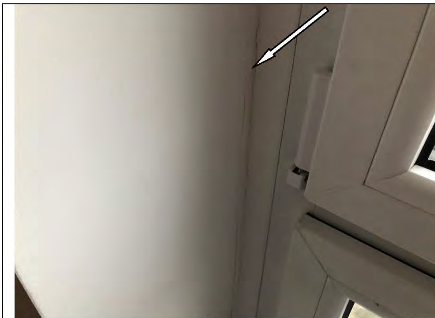
Фото №37. Неровности, сколы на окрашенных откосах оконного блока ПВХ в детской в квартире.
