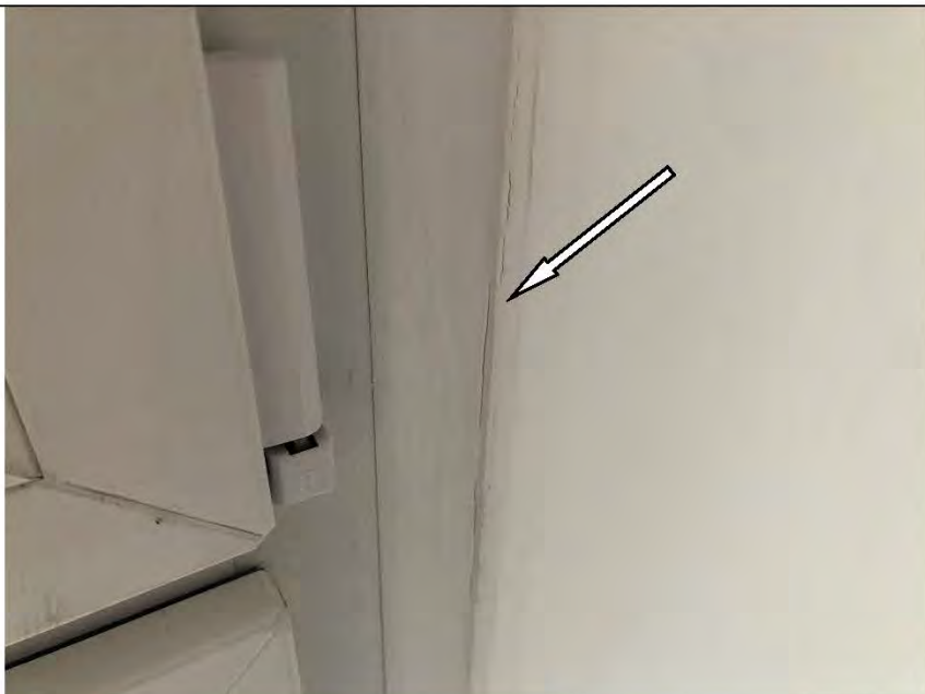
Фото №31. Инфильтрация оконного блока ПВХ в спальне в квартире.
