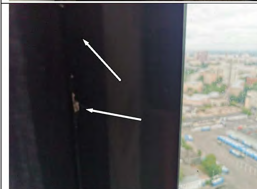
Фото №50. Царапины на металлическом профиле оконного блока в детской.
