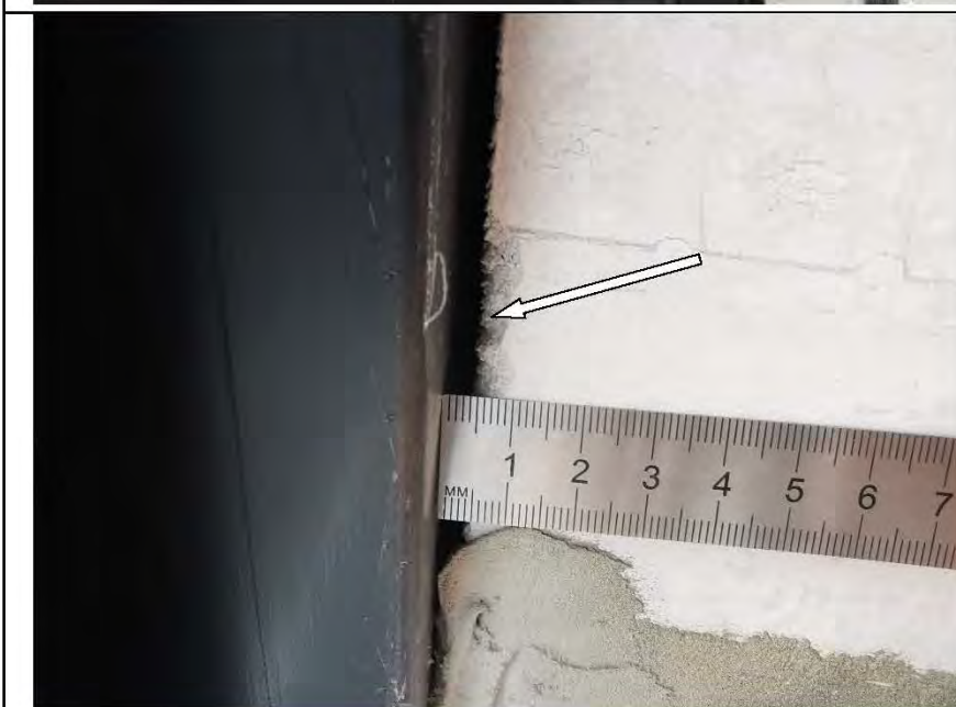
Фото №54. Зазор в узле примыкания металлического оконного блока к стеновому проему в кухне.
