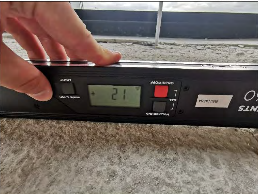
Фото №15. Измерение уровня пола в спальне.
