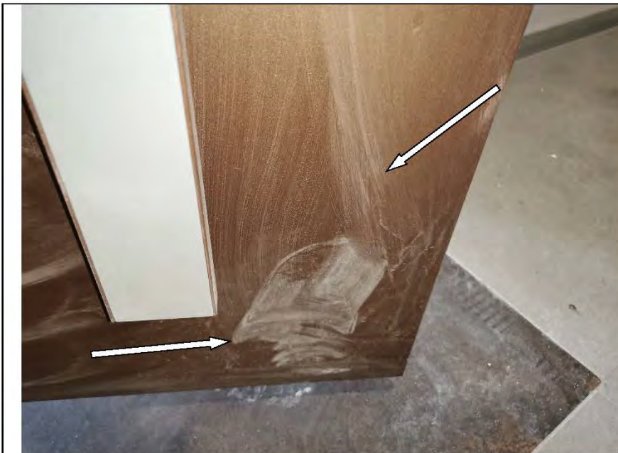
Фото №58. Загрязнение полотна входного дверного блока.
