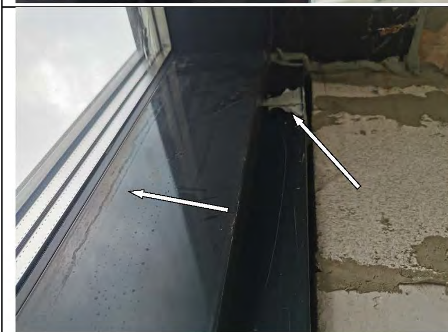
Фото №51. Царапины и загрязнения на металлическом профиле оконного блока в детской.
