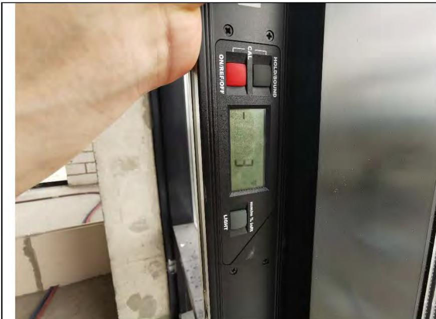
Фото №34. Отклонение металлического оконного блока в спальне.
