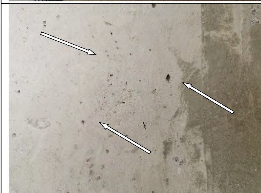
Фото №21. Отсутствие однородности внешнего вида поверхности железобетонной стены в кухне.
