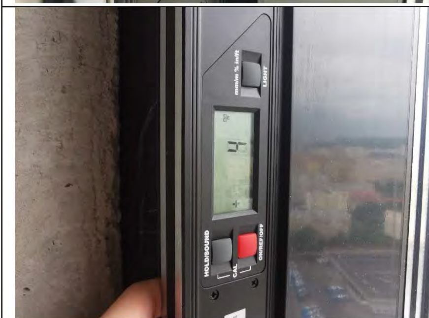
Фото №36. Отклонение металлического оконного блока в гостиной.
