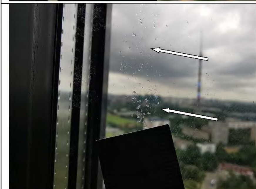
Фото №39. Окалины на стеклопакете металлического оконного блока в кухне.
