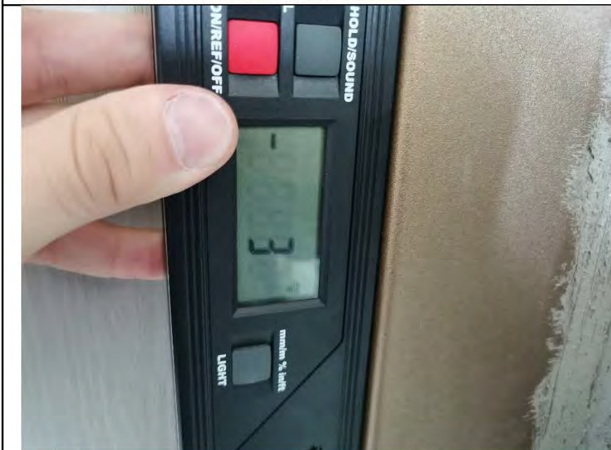
Фото №56. Отклонение короба входного дверного блока.
