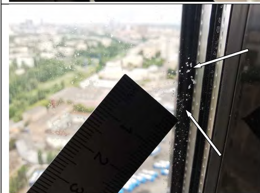
Фото №42. Окалины на стеклопакете металлического оконного блока в гостиной.
