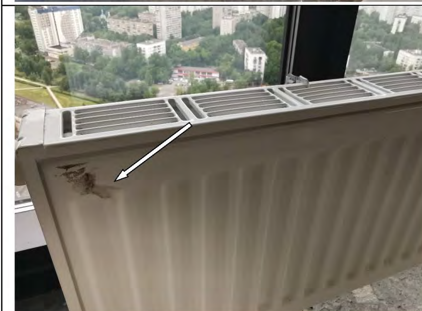
Фото №59. Загрязнение радиатора в кухне.
