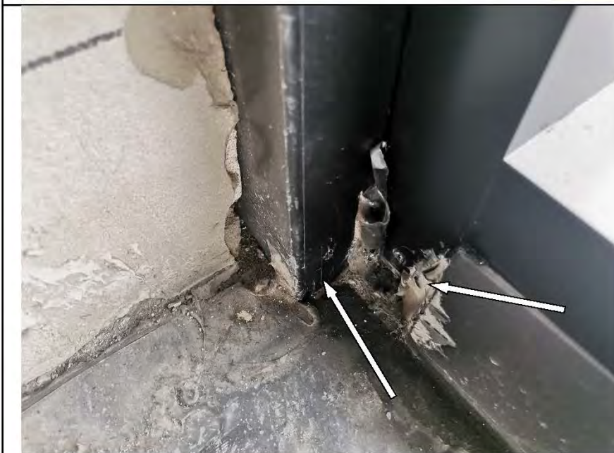
Фото №44. Царапины и загрязнения на металлическом профиле оконного блока в кухне.
