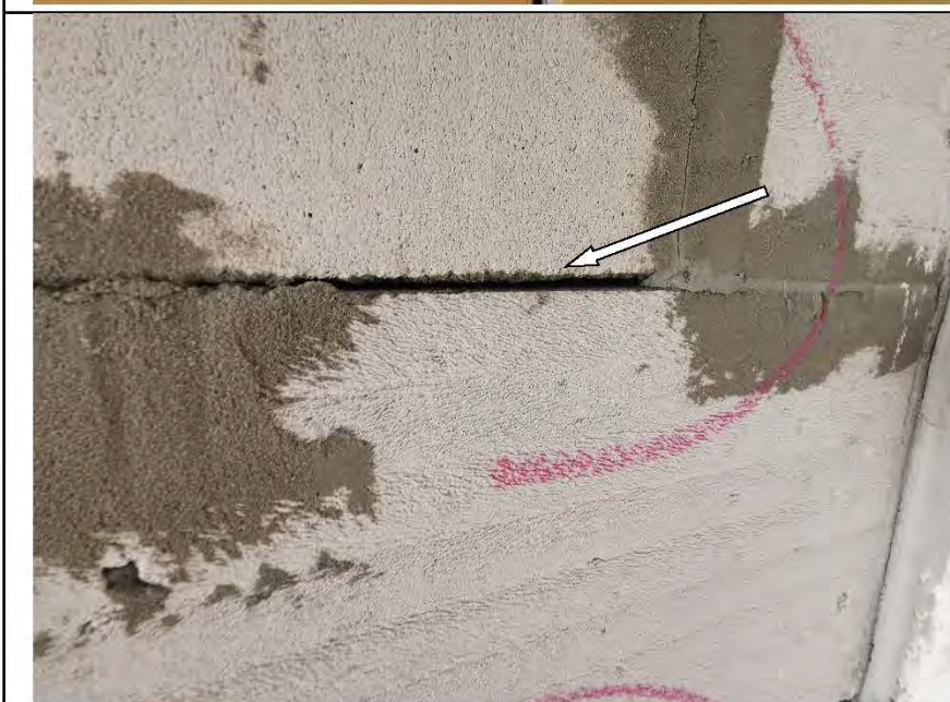
Фото №30. Некачественное выполнение швов кладки из пазогребневых блоков в гостиной.
