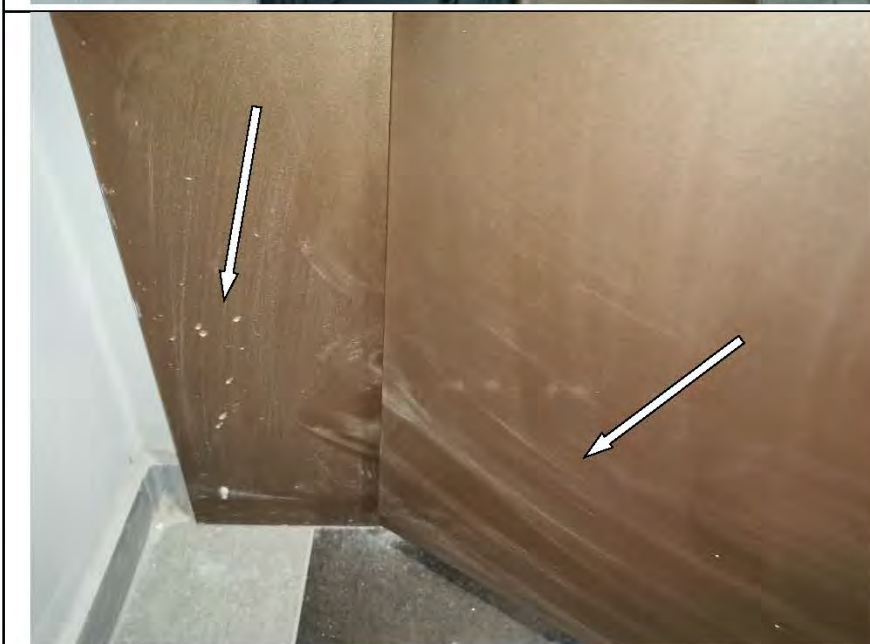
Фото №57. Загрязнение короба и полотна входного дверного блока.
