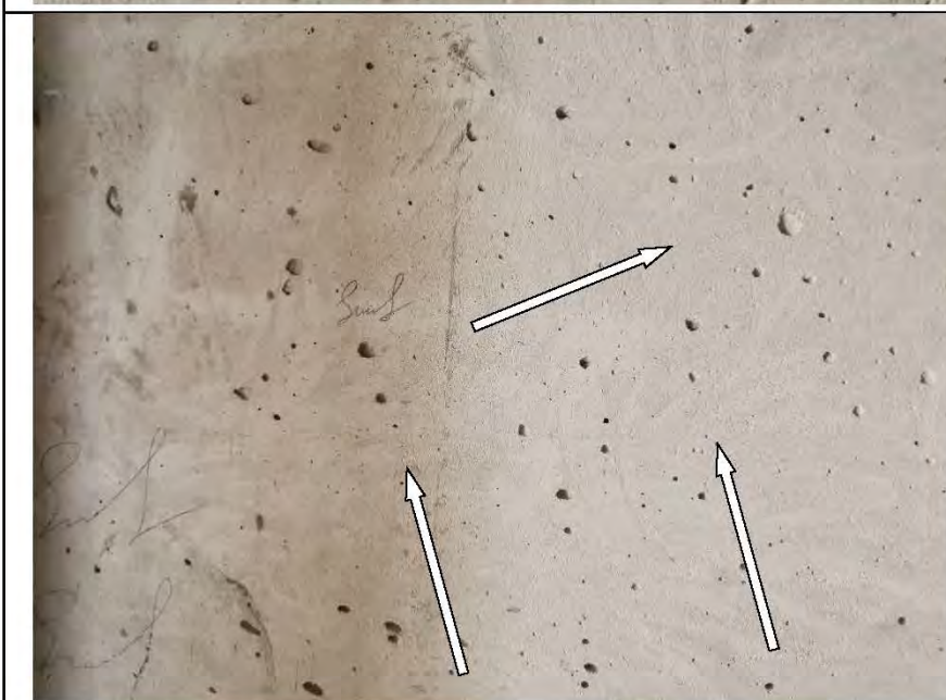
Фото №24. Отсутствие однородности внешнего вида поверхности железобетонной стены в ванной комнате.
