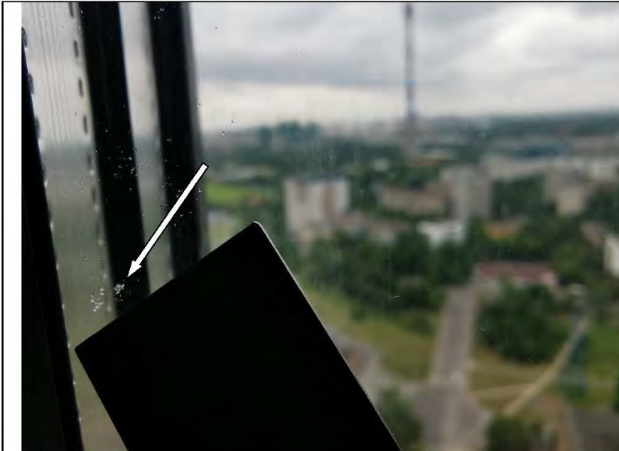
Фото №37. Окалины на стеклопакете металлического оконного блока в кухне.
