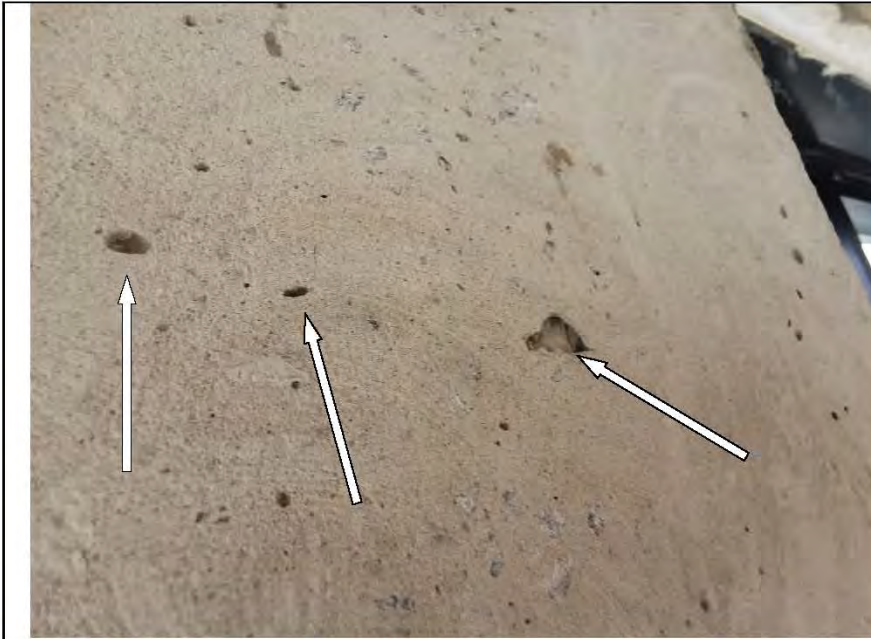
Фото №22. Отсутствие однородности внешнего вида поверхности железобетонной стены в спальне.
