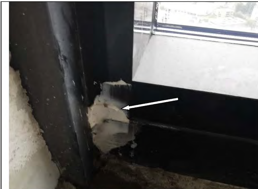
Фото №49. Загрязнения на металлическом профиле оконного блока в спальне.
