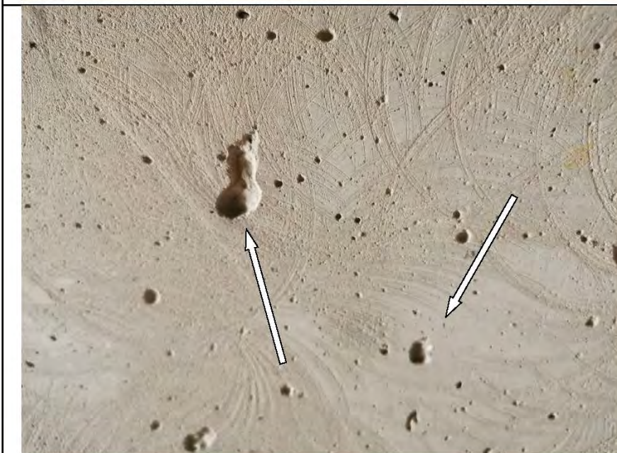
Фото №23. Отсутствие однородности внешнего вида поверхности железобетонной стены в ванной комнате.
