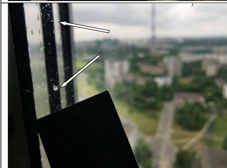
Фото №38. Окалины на стеклопакете металлического оконного блока в кухне.
