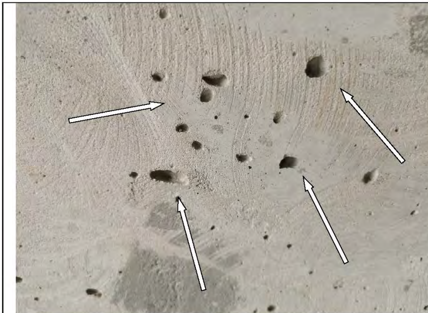
Фото №25. Отсутствие однородности внешнего вида поверхности железобетонной стены в детской.
