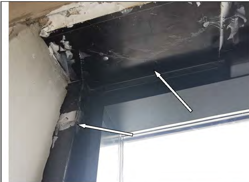
Фото №46. Загрязнения на металлическом профиле оконного блока в кухне.
