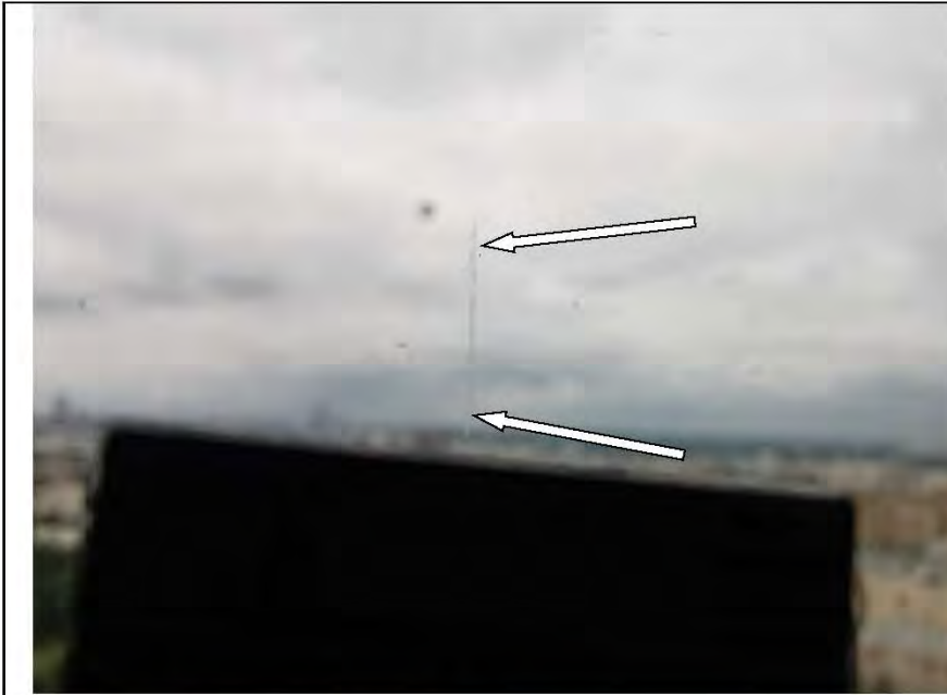
Фото №43. Царапины на стеклопакете металлического оконного блока в гостиной.
