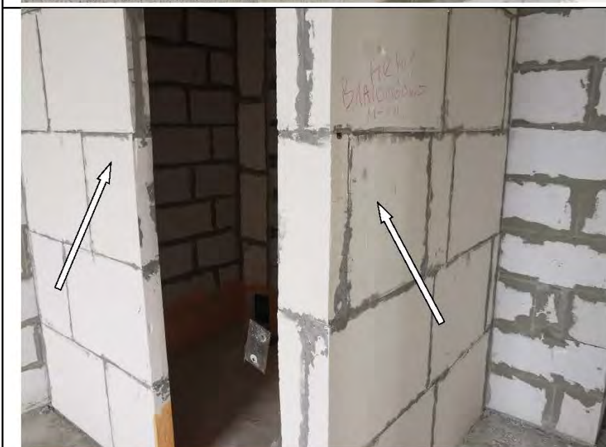
Фото №32. Перегородки из пазогребневых блоков выполнены не из влагостойкого материала.
