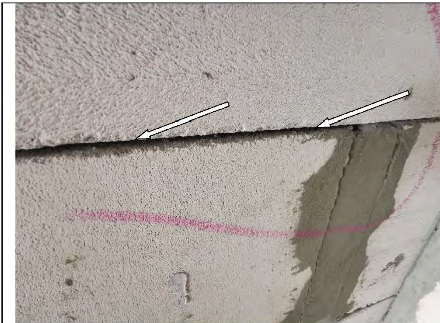
Фото №31. Некачественное выполнение швов кладки из пазогребневых блоков в гостиной.
