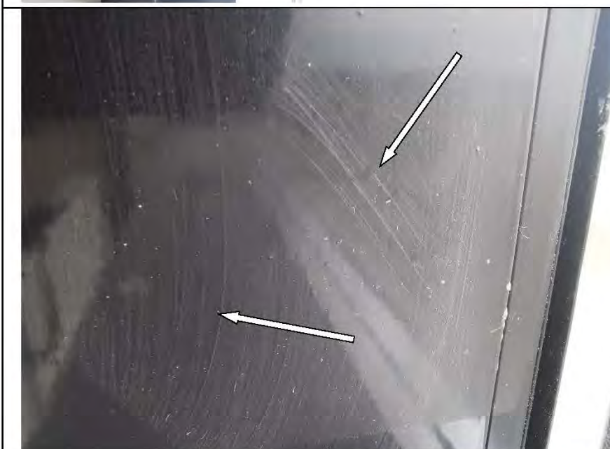
Фото №47. Загрязнения и царапины на металлическом профиле оконного блока в спальне.
