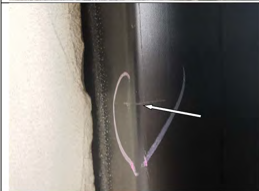
Фото №45. Царапины на металлическом профиле оконного блока в кухне.
