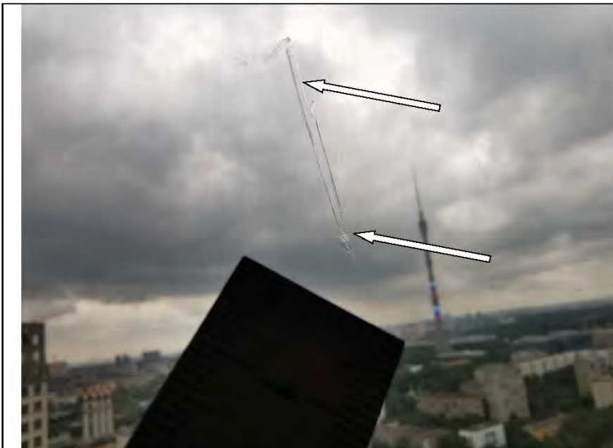
Фото №40. Царапины на стеклопакете металлического оконного блока в кухне.
