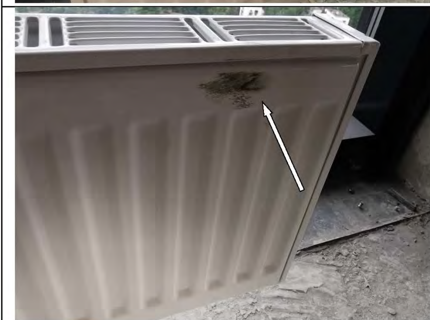
Фото №60. Загрязнение радиатора в кухне.
