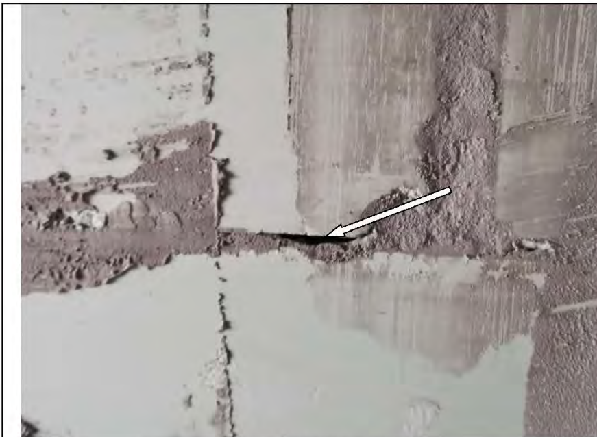
Фото №28. Некачественное выполнение швов кладки из пазогребневых блоков в первом санузле.
