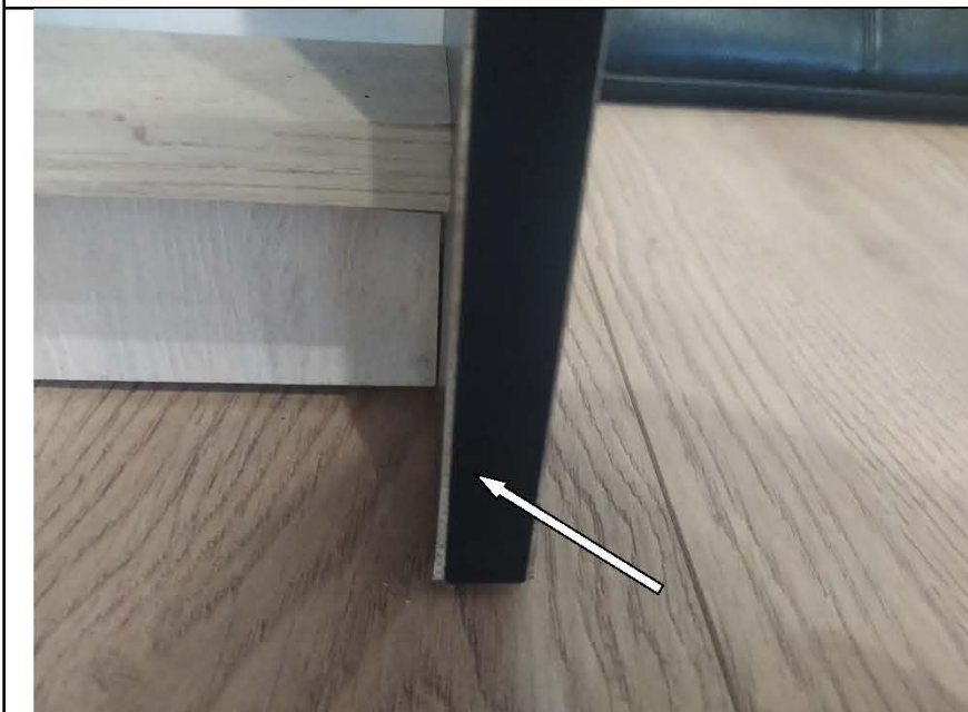
Фото №14. Набухание, отслоение ламинации на ЛДСП панелях тумбы под телевизор характерные последствиям залития.
