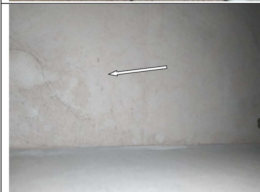
Фото №9. Следы заливки напольной керамической плитки в ванной комнате (пожелтения).
