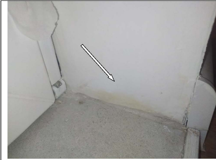
Фото №10. Откосы дверного блока ПВХ в кухне-гостиной имеют следы залития.
