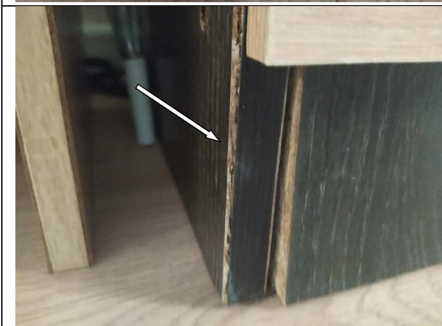
Фото №15. Набухание, отслоение ламинации на ЛДСП панелях шкафа характерные последствиям залития.
