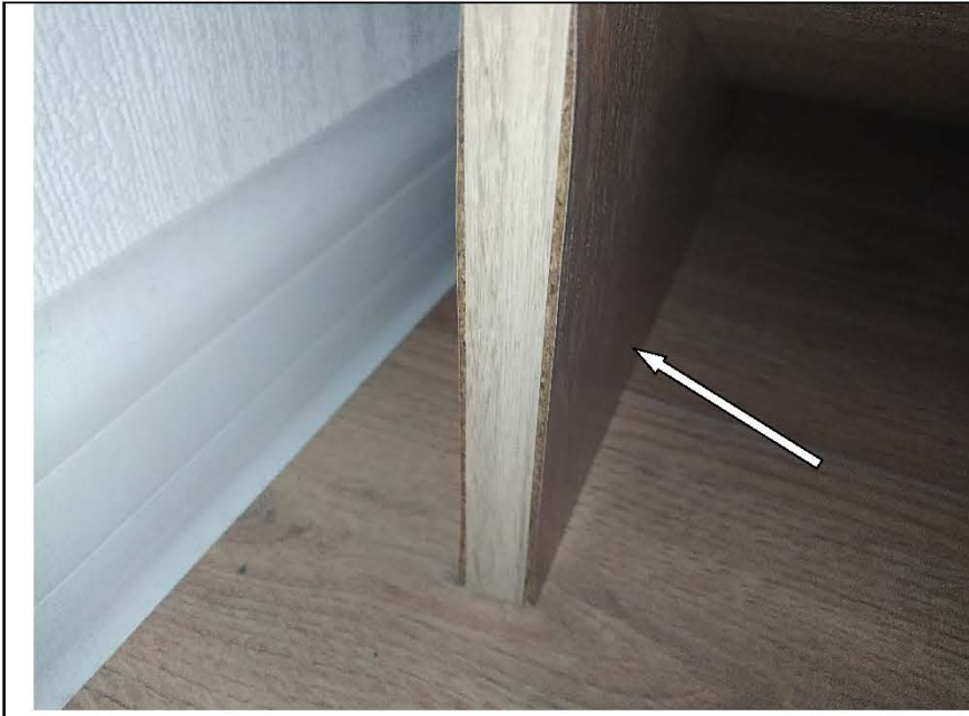
Фото №16. Набухание ЛДСП панелей обувницы характерное последствиям заливки.
