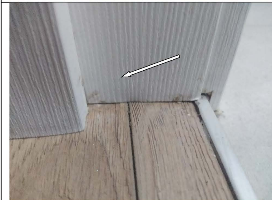
Фото №8. Коробка деревянного дверного блока деформировано в ванной комнате.
