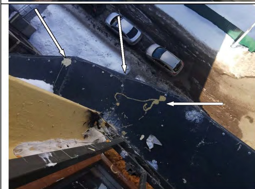
Фото №69. Дефекты на металлическом отливе оконного блока ПВХ на лоджии (загрязнение, замятие).
