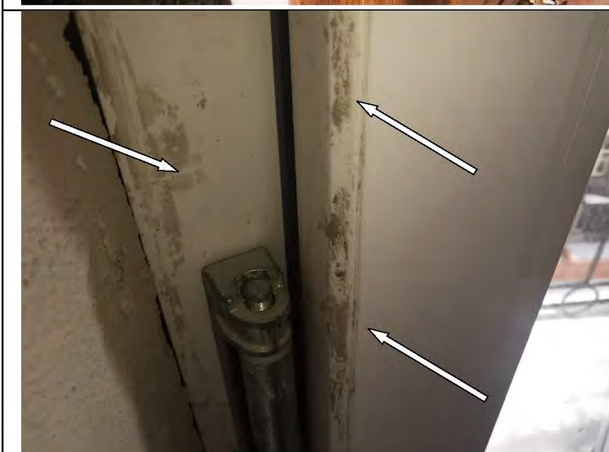
Фото №21. Загрязнение профиля ПВХ оконного блока в кухне.
