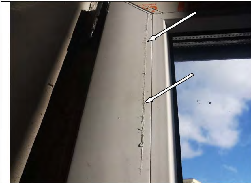
Фото №19. Царапины на профиле ПВХ оконного блока в кухне.
