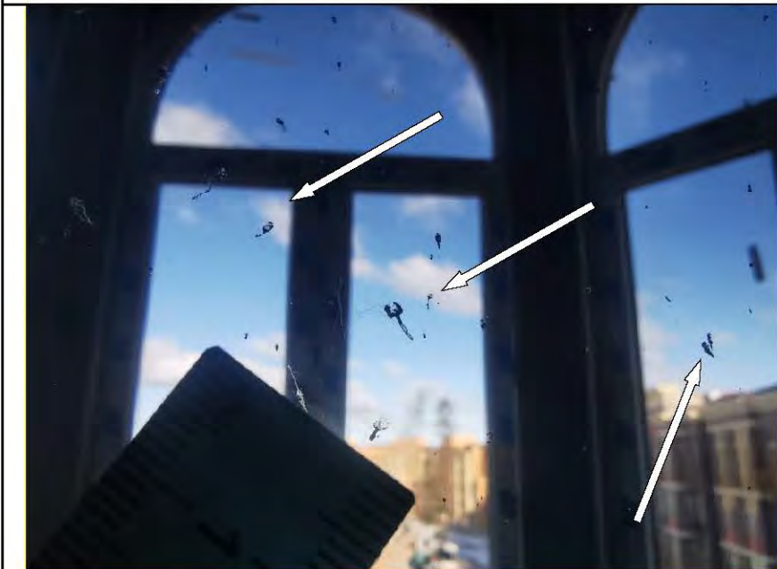
Фото №38. Окалины на стеклопакете оконного блока ПВХ в спальне.
