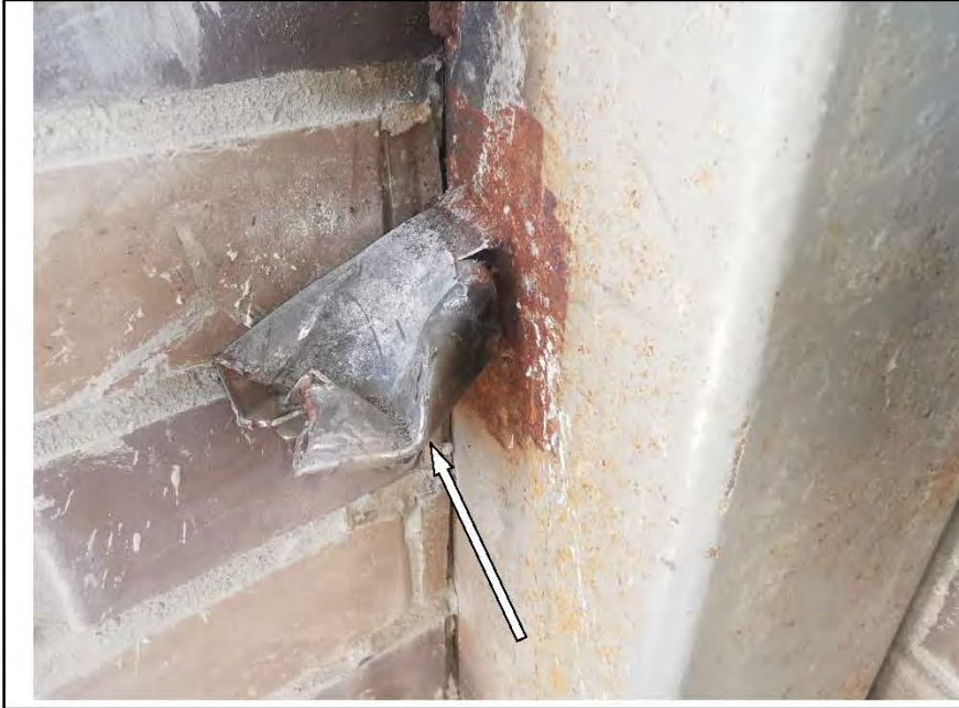
Фото №73. Дефект устройства металлической колонны на лоджии.
