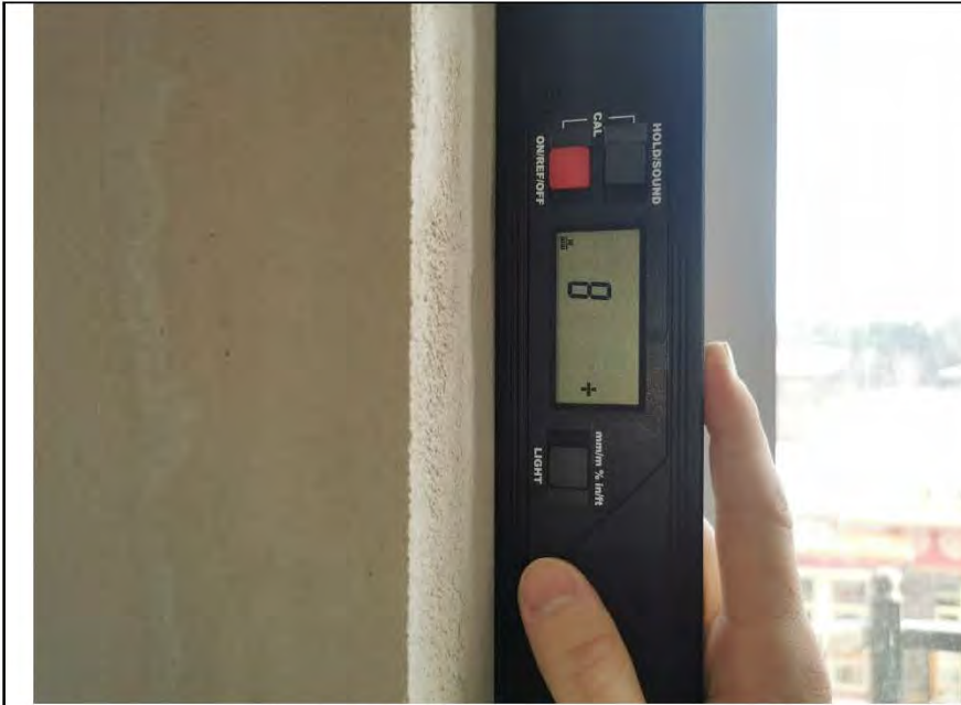
Фото №16. Откос оконного блока в кухне имеет отклонение 17 мм.
