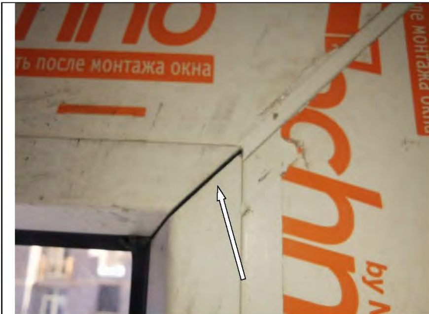
Фото №25. Зазоры в месте стыка профилей ПВХ оконного блока в гостиной.
