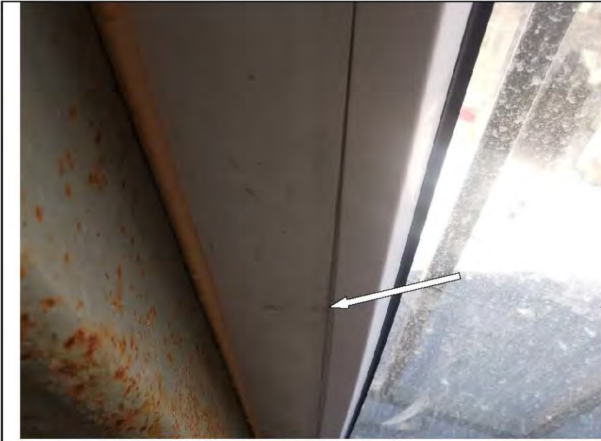
Фото №37. Зазоры в месте стыка профилей ПВХ оконного блока на лоджии.
