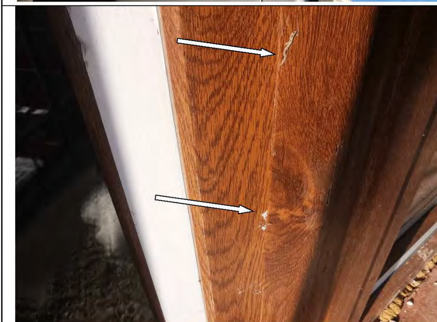
Фото №20. Потертости на профиле ПВХ оконного блока в кухне.
