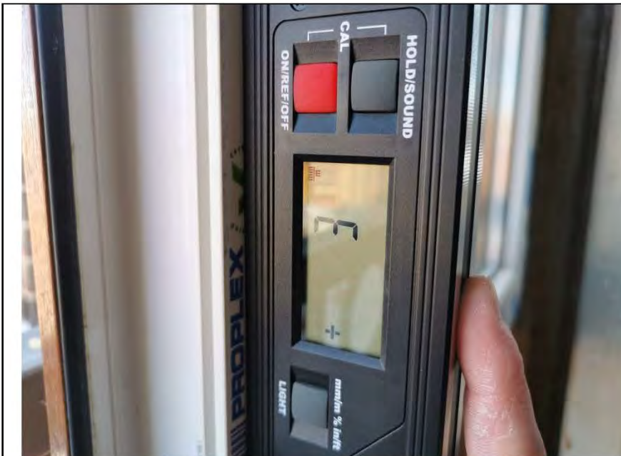
Фото №49. Отклонение ПВХ оконного блока на лоджии по уровню вертикальности.
