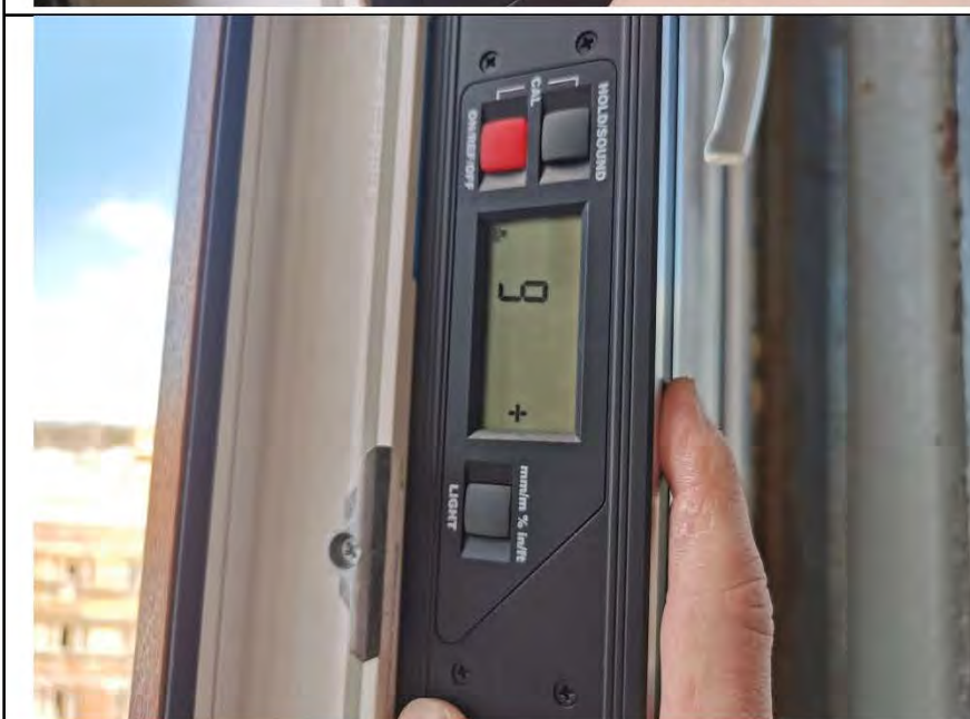
Фото №48. Отклонение ПВХ оконного блока на лоджии по уровню вертикальности.
