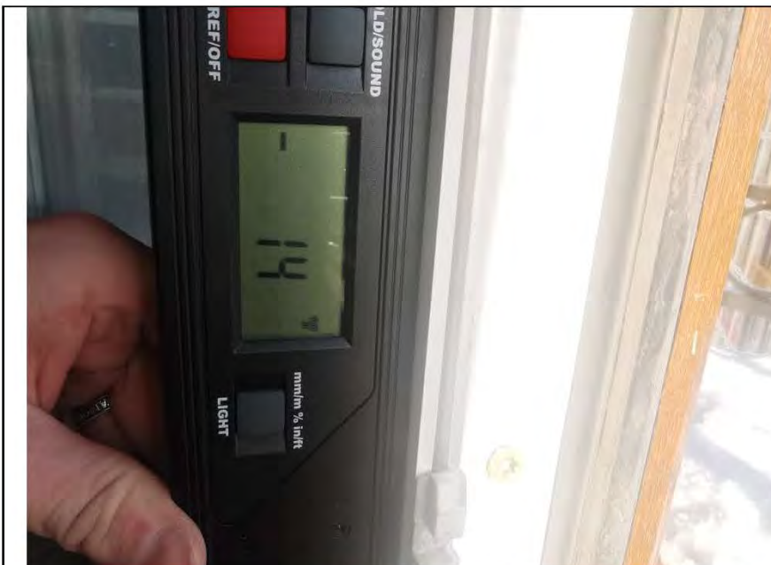
Фото №46. Отклонение ПВХ оконного блока в кухне по уровню вертикальности.
