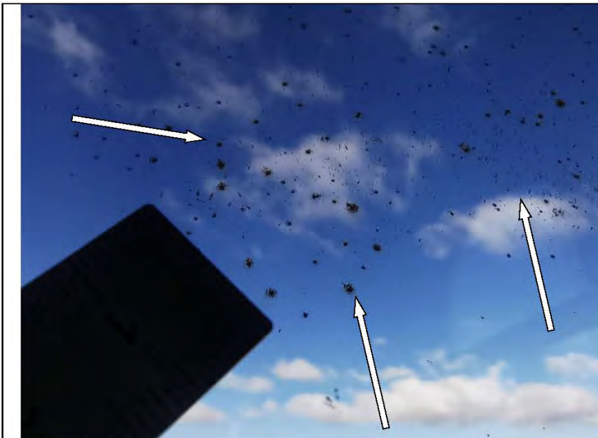
Фото №40. Окалины на стеклопакете оконного блока ПВХ на лоджии.
