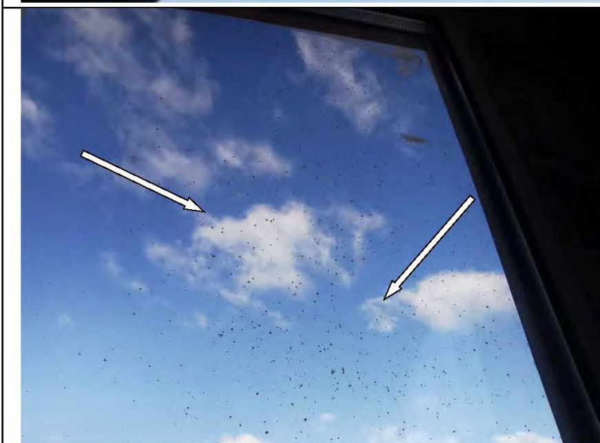
Фото №41. Окалины на стеклопакете оконного блока ПВХ на лоджии.
