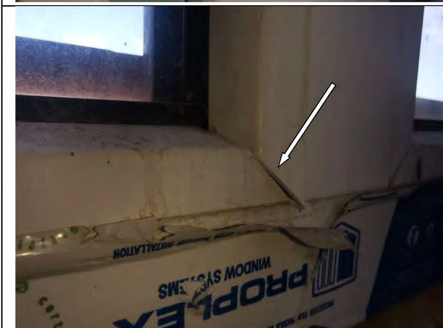
Фото №33. Зазоры в месте стыка профилей ПВХ оконного блока на лоджии.
