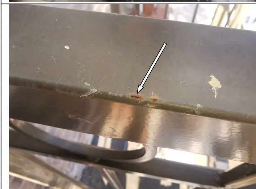
Фото №62. Коррозия на металлическом ограждении оконного блока в кухне.
