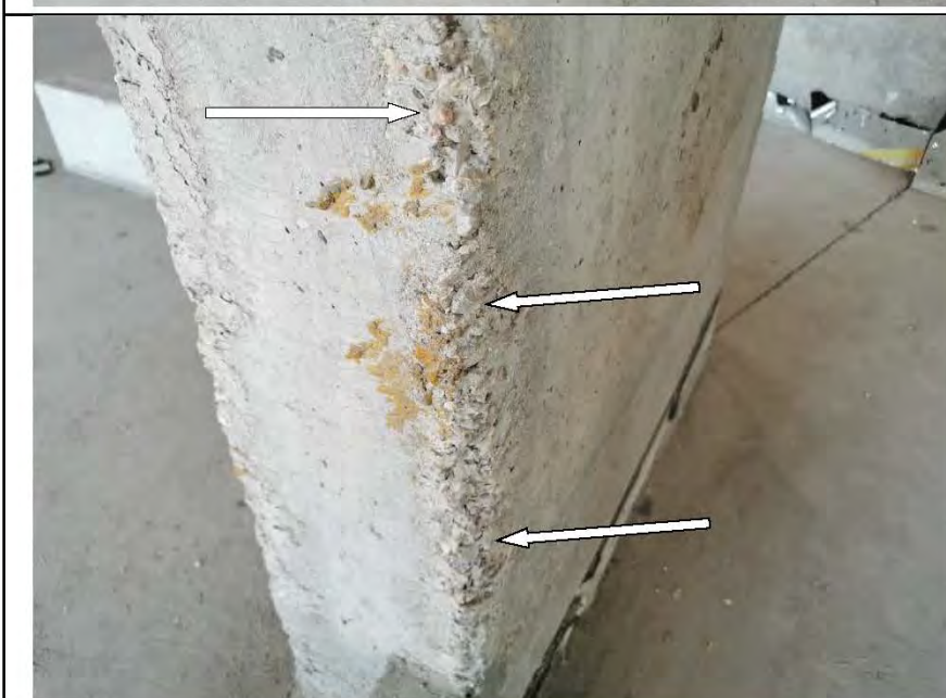
Фото №9. Железобетонные элементы конструкции в гостиной имеют дефекты (пористость).
