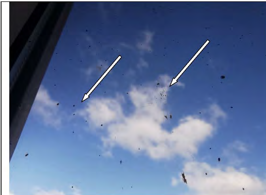
Фото №43. Окалины на стеклопакете оконного блока ПВХ на лоджии.
