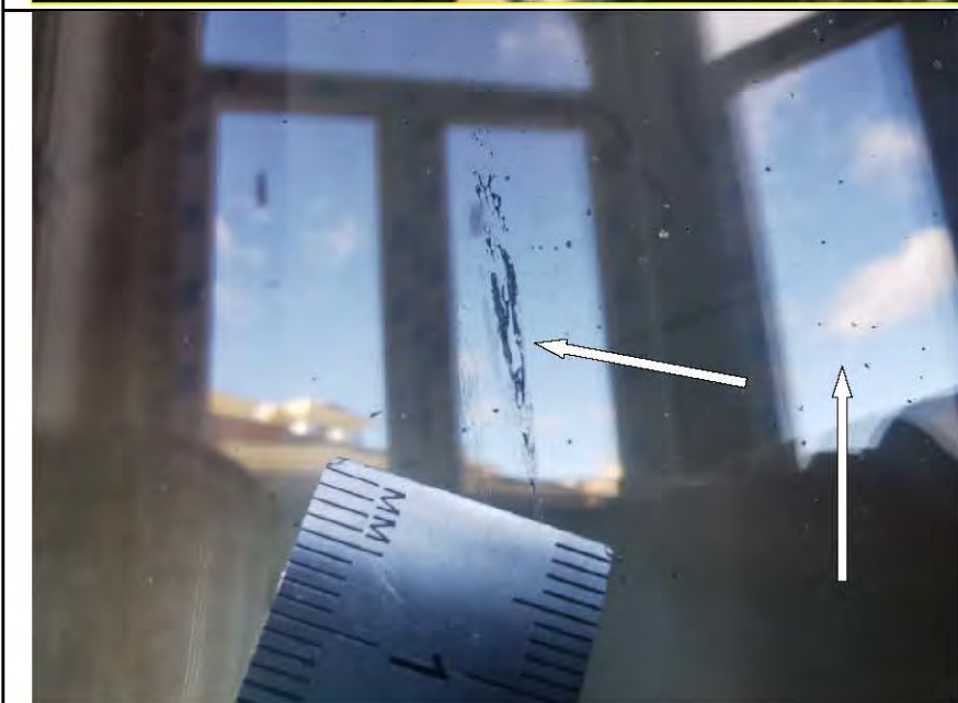
Фото №39. Окалины на стеклопакете оконного блока ПВХ в спальне.
