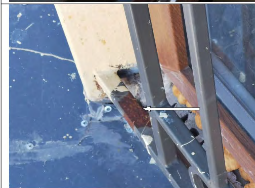
Фото №66. Коррозия на металлическом ограждении оконного блока на лоджии.
