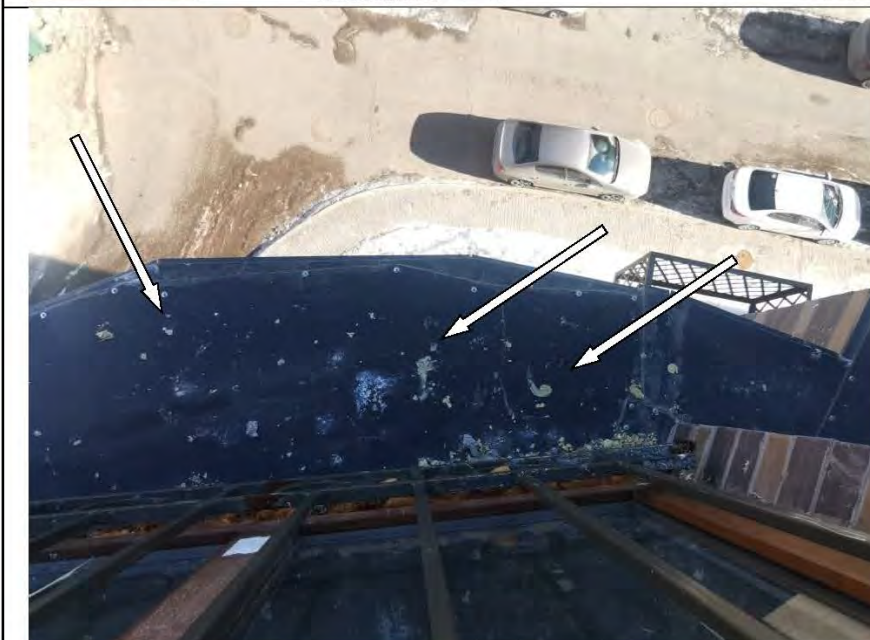
Фото №68. Загрязнение на металлическом отливе оконного блока ПВХ на лоджии.
