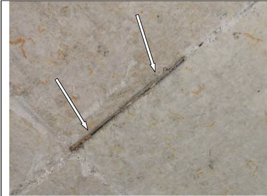
Фото №70. Не демонтированы элементы деревянной опалубки конструкций плит перекрытия в кухне.
