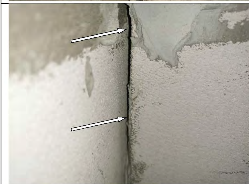
Фото №12. Некачественное устройство швов кладки из газобетонных блоков в санузле.
