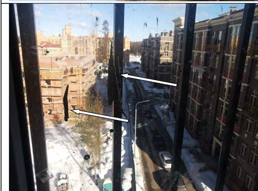
Фото №45. Загрязнения на стеклопакете оконного блока ПВХ на лоджии.
