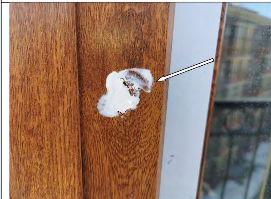
Фото №29. Загрязнения на профиле ПВХ оконного блока в спальне.
