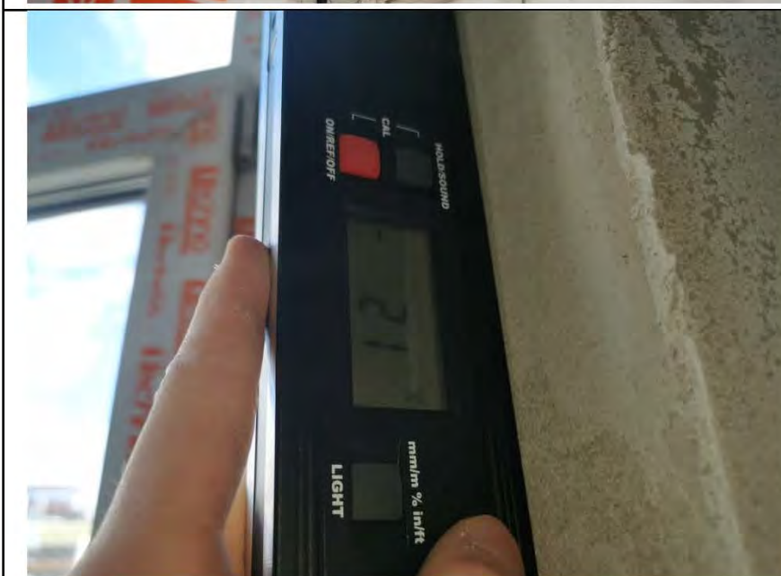
Фото №23. Откос оконного блока в гостиной имеет отклонение 21 мм.
