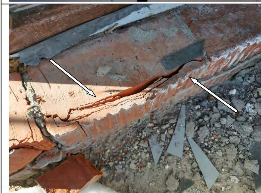
Фото №59. Разрушение конструкции кирпичной кладки в гостиной.
