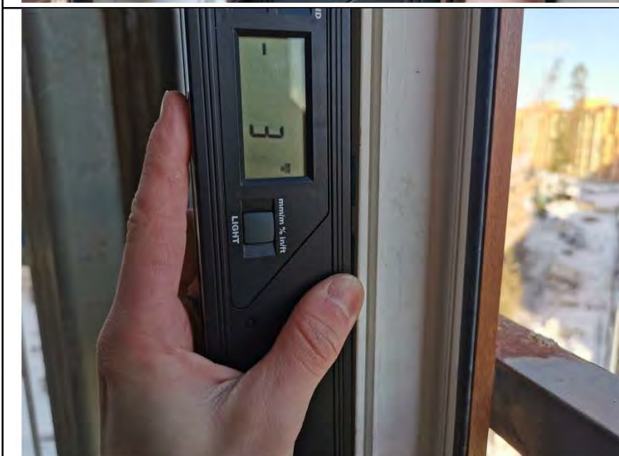
Фото №50. Отклонение ПВХ оконного блока на лоджии по уровню вертикальности.
