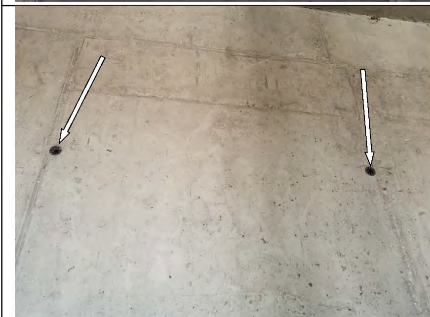
Фото №8. Отсутствие однородности внешнего вида железобетонных конструкций в коридоре (не заделаны отверстия в монолитной стене).
