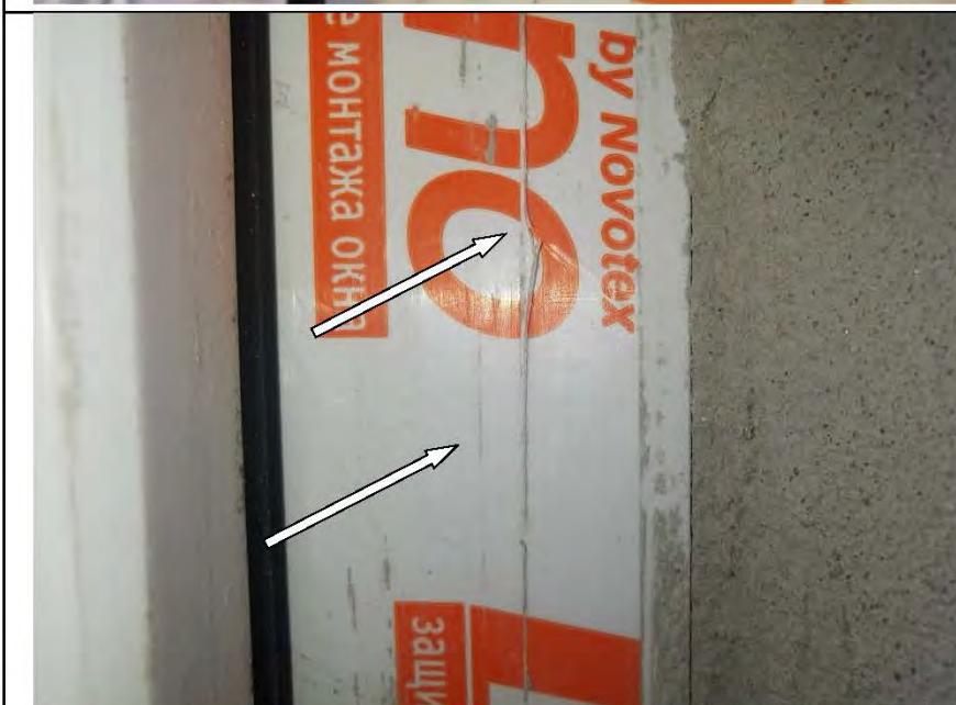
Фото №26. Царапины на профиле ПВХ оконного блока в гостиной.
