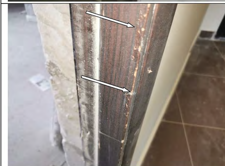
Фото №54. Коробка входного деревянного дверного блока имеет дефекты (потертости, царапины)
