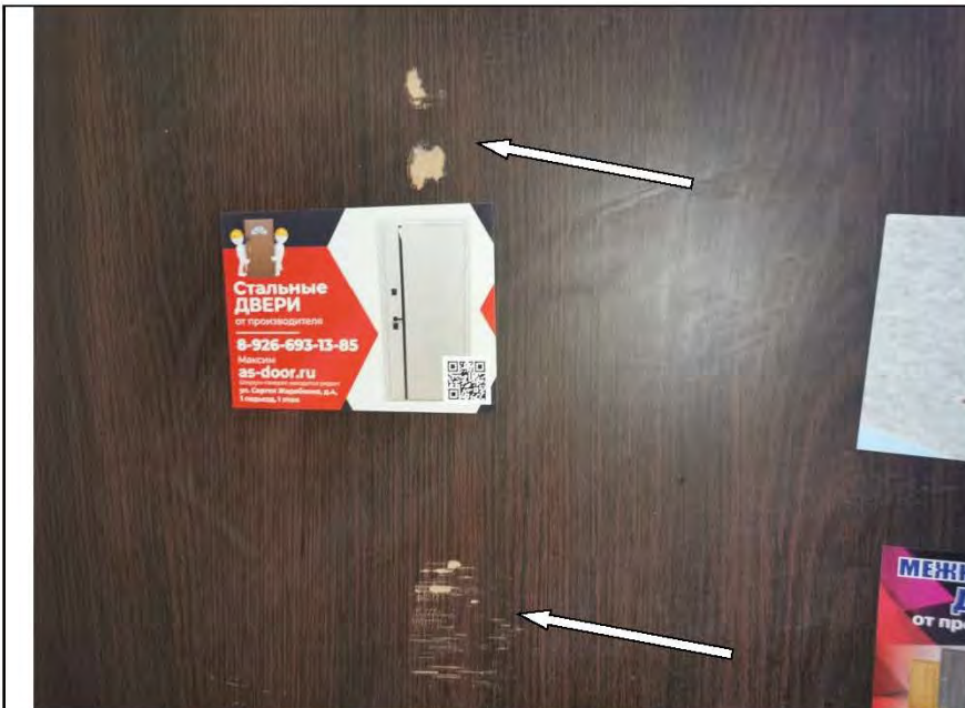
Фото №52. Механические повреждения на лицевой поверхности полотна входного дверного блока.
