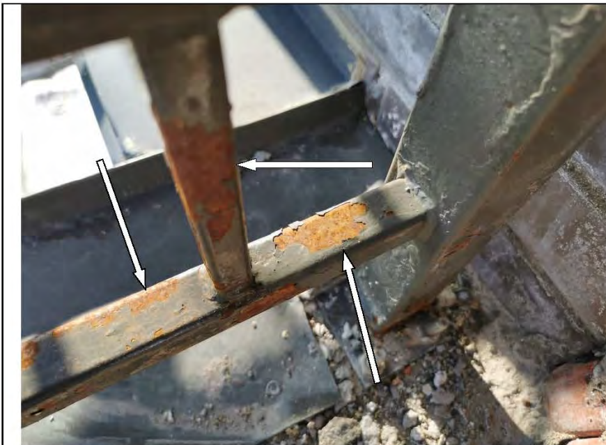
Фото №64. Коррозия на металлическом ограждении оконного блока в гостиной.
