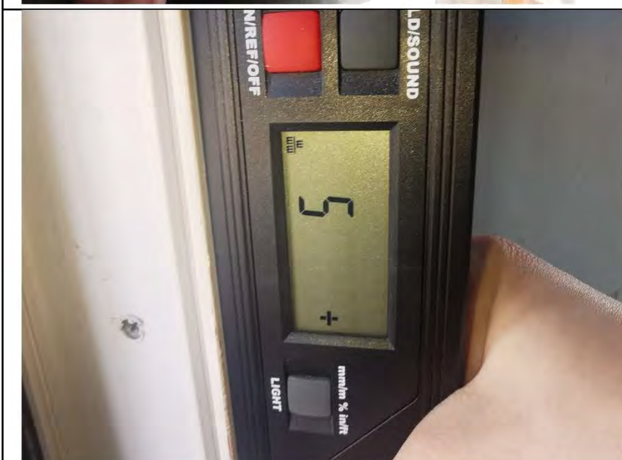
Фото №47. Отклонение ПВХ оконного блока в спальне по уровню вертикальности.
