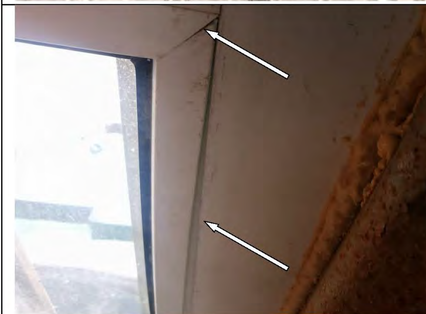
Фото №36. Зазоры в месте стыка профилей ПВХ оконного блока на лоджии.
