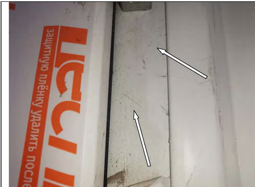
Фото №22. Царапины на профиле ПВХ оконного блока в кухне.
