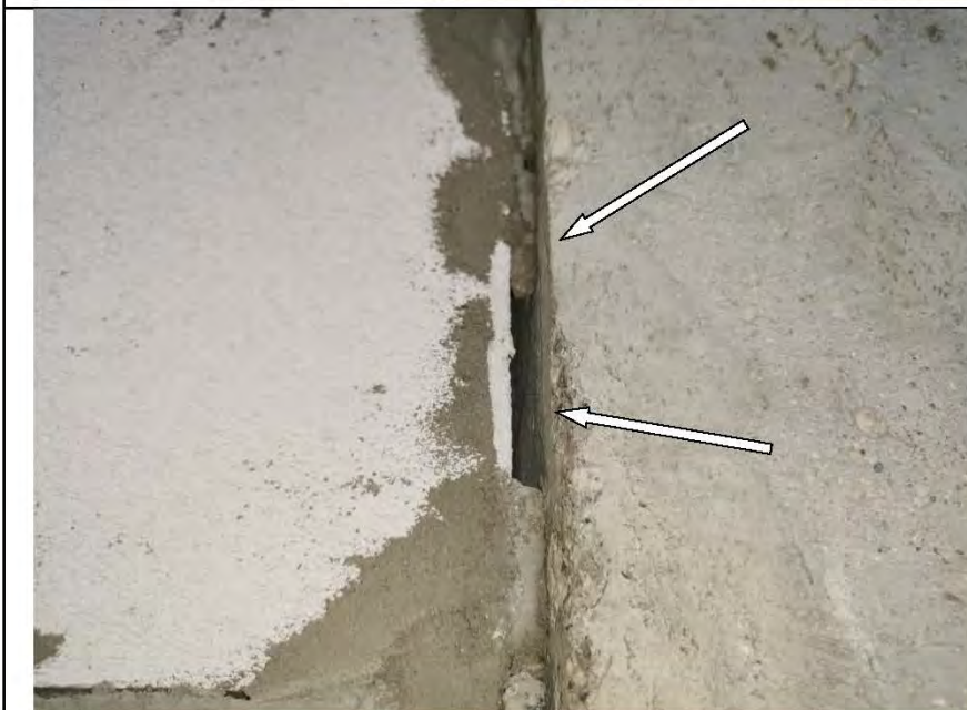
Фото №11. Некачественное устройство швов кладки из газобетонных блоков в коридоре.
