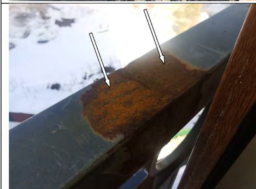
Фото №65. Коррозия на металлическом ограждении оконного блока на лоджии.
