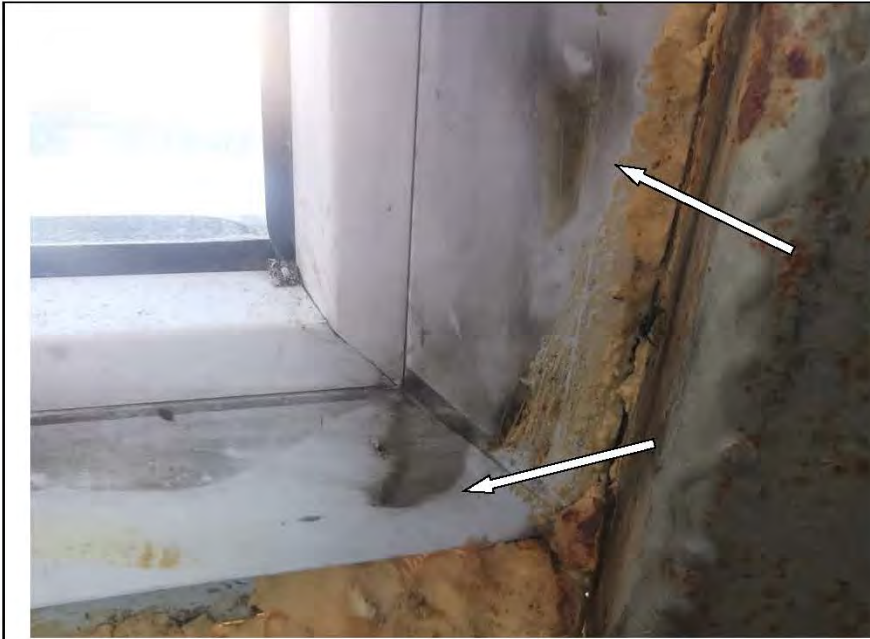
Фото №34. Загрязнения на профиле ПВХ оконного блока на лоджии.
