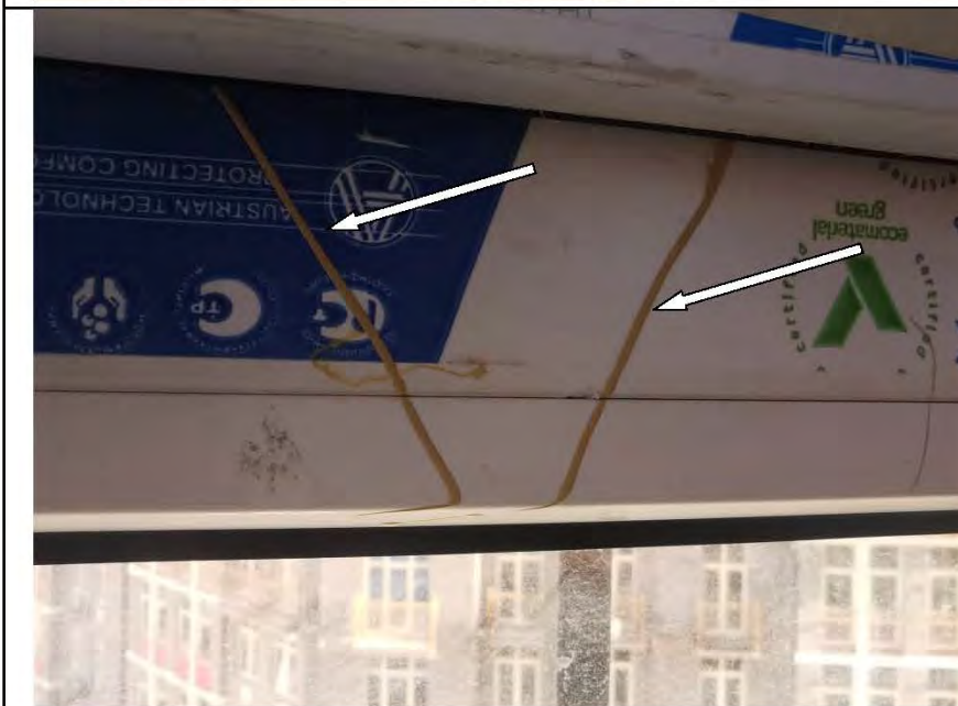
Фото №35. Загрязнения на профиле ПВХ оконного блока на лоджии.
