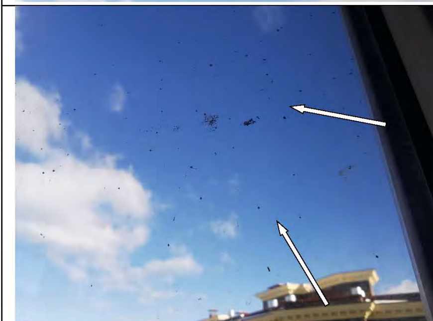
Фото №44. Окалины на стеклопакете оконного блока ПВХ на лоджии.
