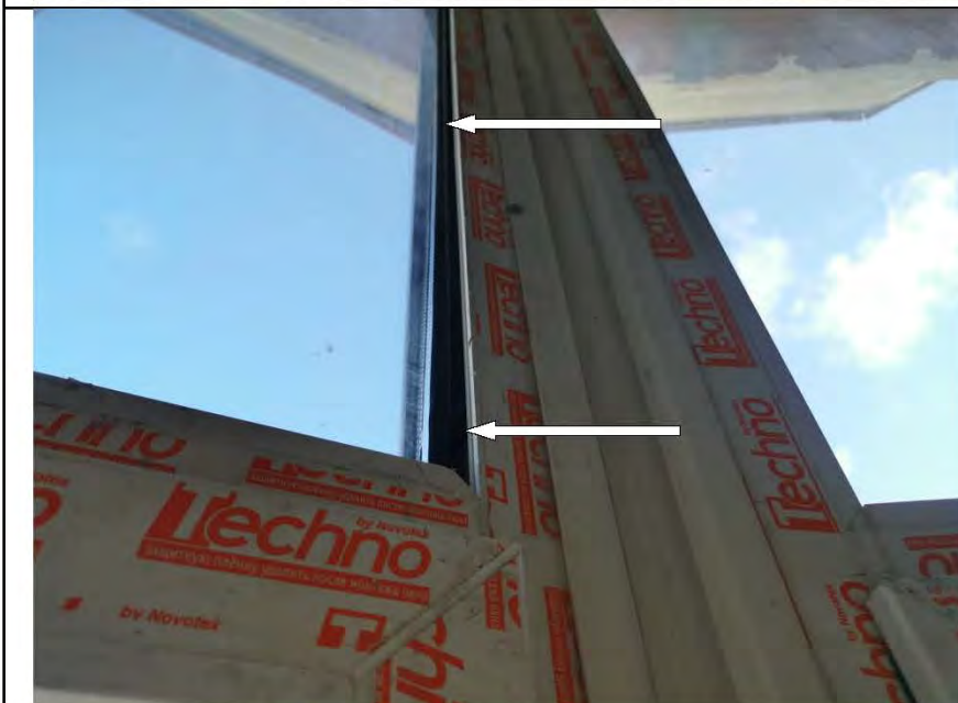
Фото №71. Отсутствует часть штапика на оконном блоке ПВХ в спальне.
