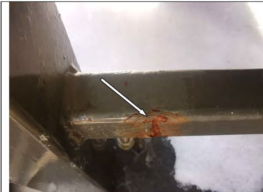
Фото №61. Коррозия на металлическом ограждении оконного блока в кухне.
