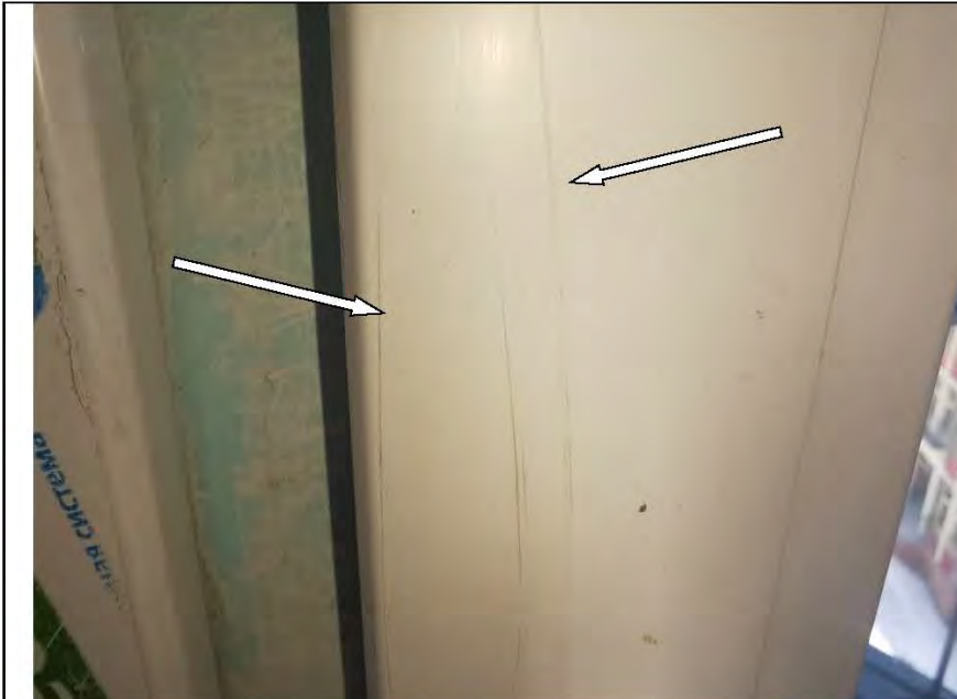
Фото №31. Царапины на профиле ПВХ оконного блока в спальне.
