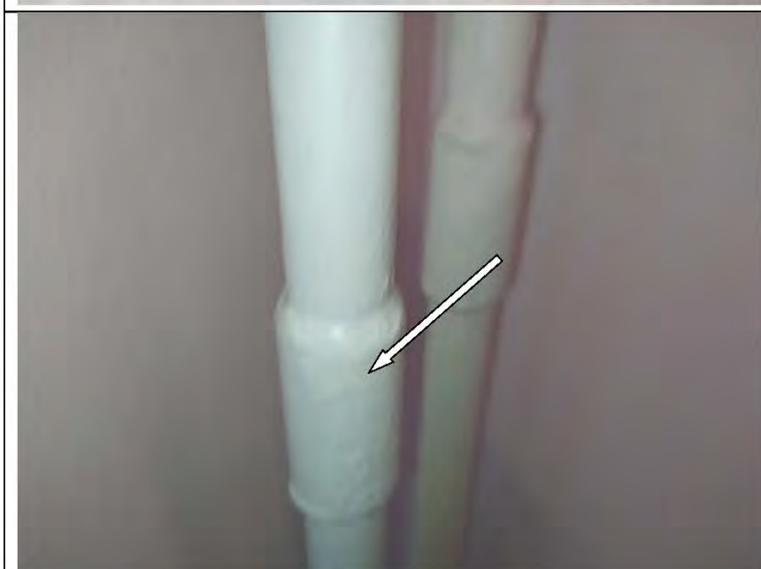
Фото №65. Окрашивание труб отопления в гостиной выполнено с дефектами (подтеки).
