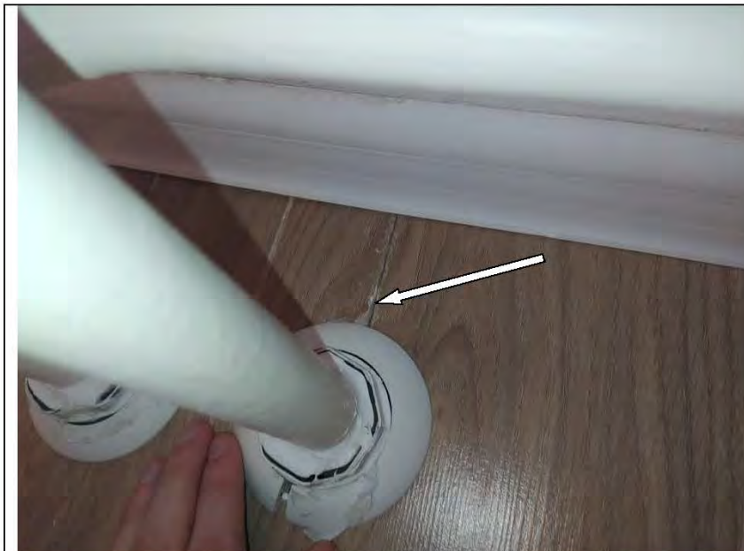
Фото №58. Дефект заделки отверстия для трубопровода отопления в напольном покрытии из ламината в кухне.
