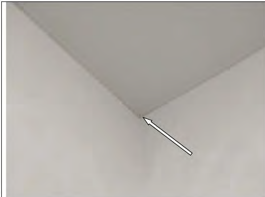
Фото №70. Дефект монтажа декоративного молдинга натяжного потолка в прихожей.
