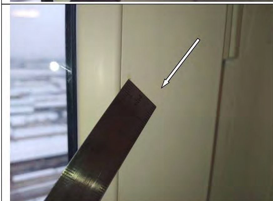
Фото №29. Профиль ПВХ оконного блока №3 в кухне имеет дефекты (царапина).
