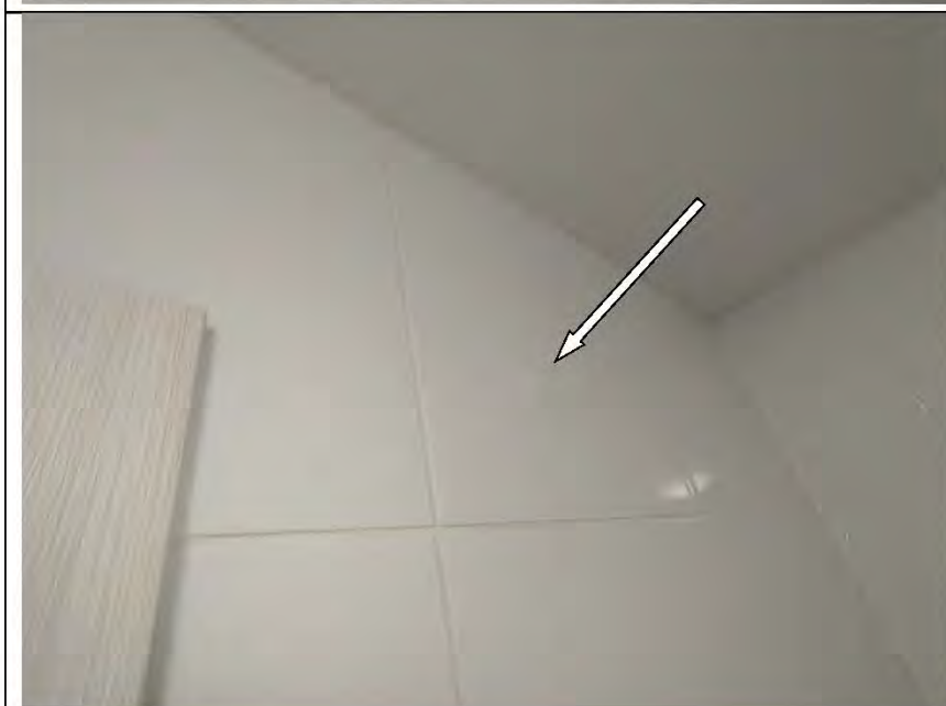
Фото №56. На настенной керамической плитке в ванной комнате имеются дефекты (загрязнения).
