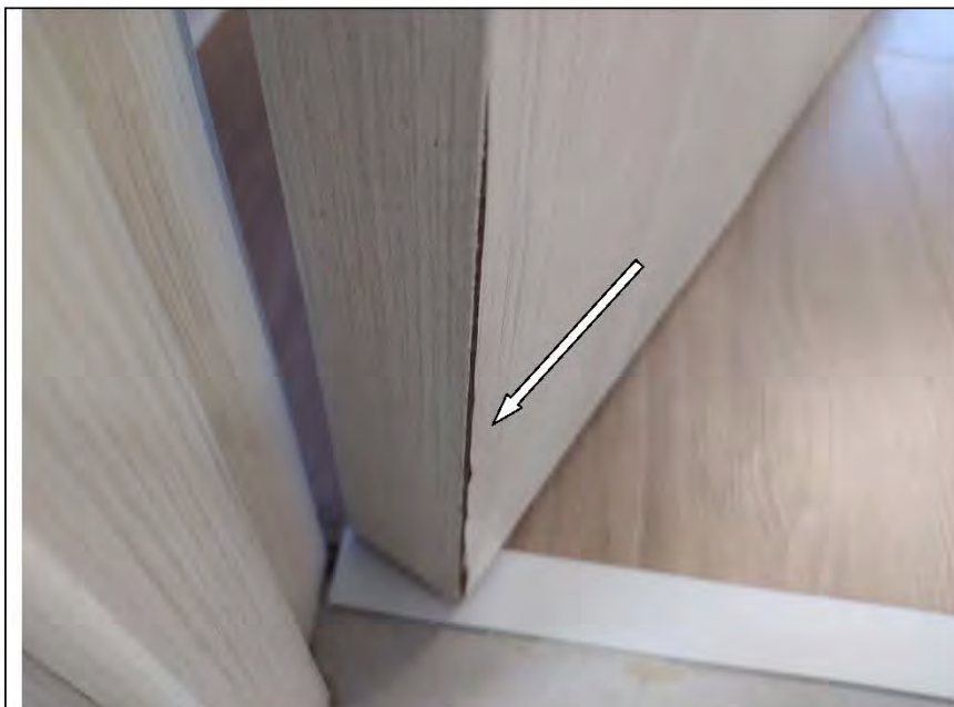
Фото №46. Дефекты (отслоение ламинации) на лицевой поверхности полотна деревянного дверного блока в спальне.
