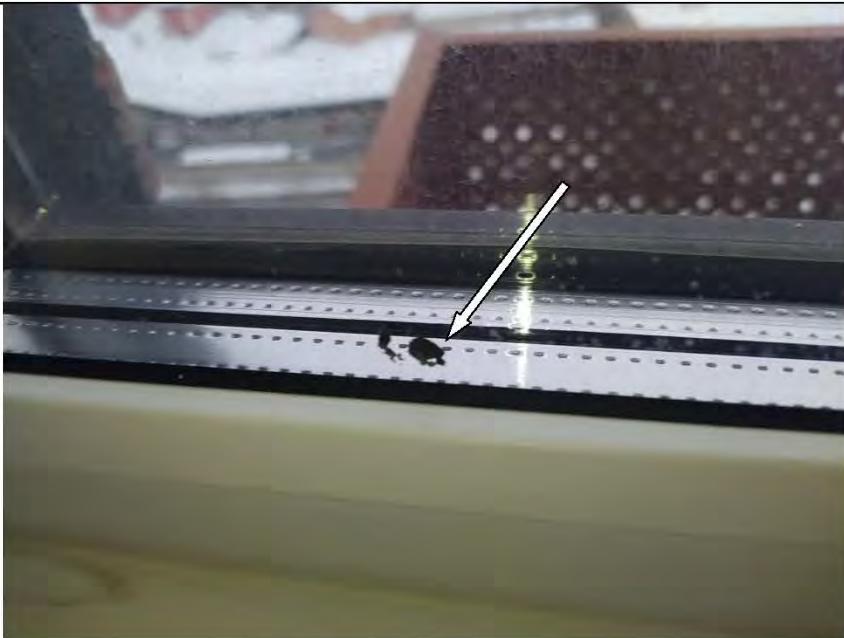
Фото №32. На стеклопакете оконного блока ПВХ №4 в кухне имеется дефект (загрязнение малярными составами).
