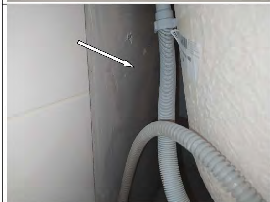
Фото №74. Частично отсутствует настенная керамическая плитка за ванной.
