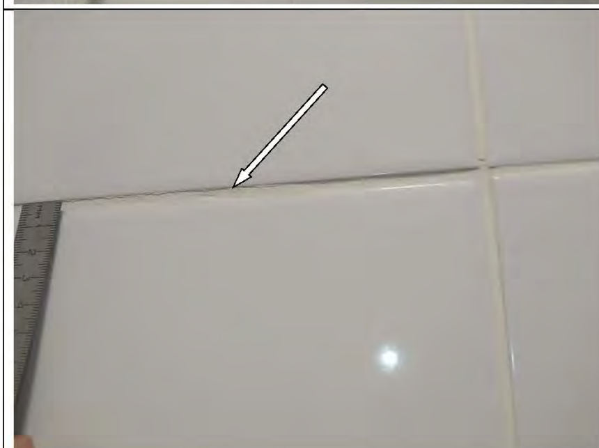
Фото №57. Затирка настенной плитки в санузле выполнена с нарушениями.
