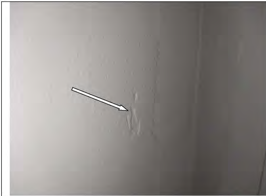
Фото №16. Раковины на окрашенной поверхности откосов оконного блока №1 в гостиной.
