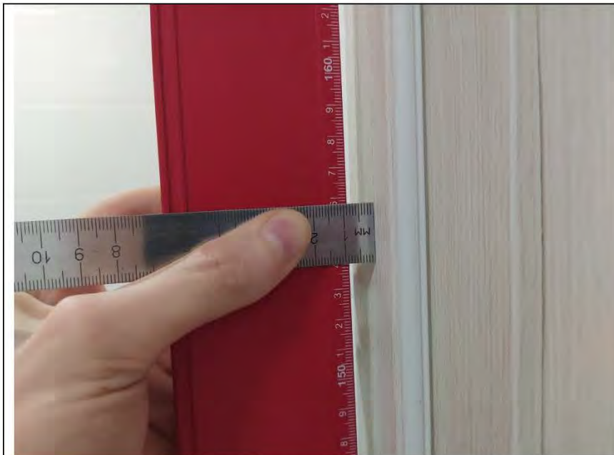
Фото №40. Отклонение коробки дверного блока в санузле.
