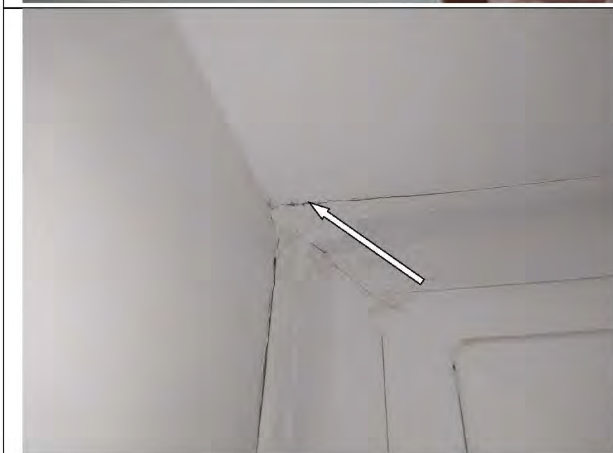
Фото №21 Оконный блок № 3 в кухне имеет щели, через которые происходит инфильтрация воздуха внутрь помещения.
