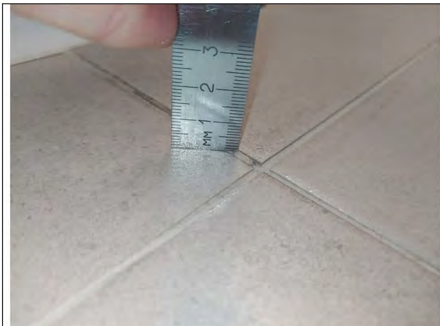
Фото №64. Уступы керамической плитки пола в прихожей.
