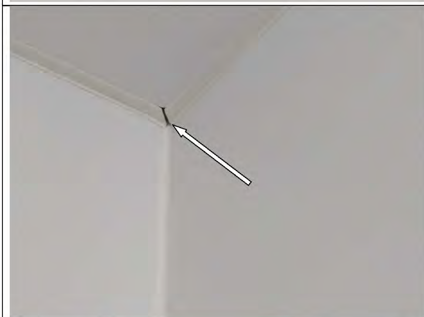
Фото №71. Дефект монтажа декоративного молдинга натяжного потолка в ванной комнате.
