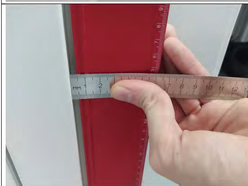
Фото №72. Отклонение коробки входного дверного блока
