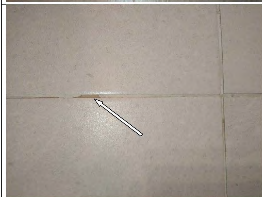
Фото №63. Затирка напольной плитки выполнена с нарушениями в кухне (каверны).
