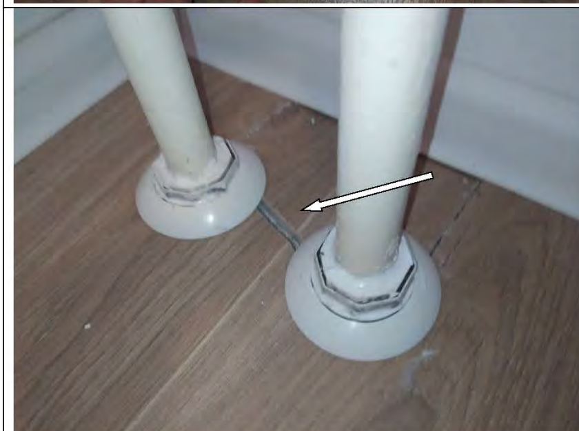
Фото №59. Дефект заделки отверстия для трубопровода отопления в напольном покрытии из ламината в спальне.
