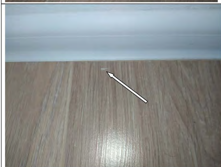
Фото №60. Загрязнения на поверхности ламината в гостиной.
