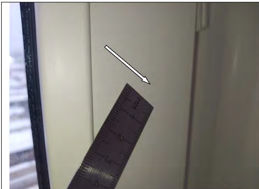
Фото №28. Профиль ПВХ оконного блока в спальне имеет дефекты (царапина).
