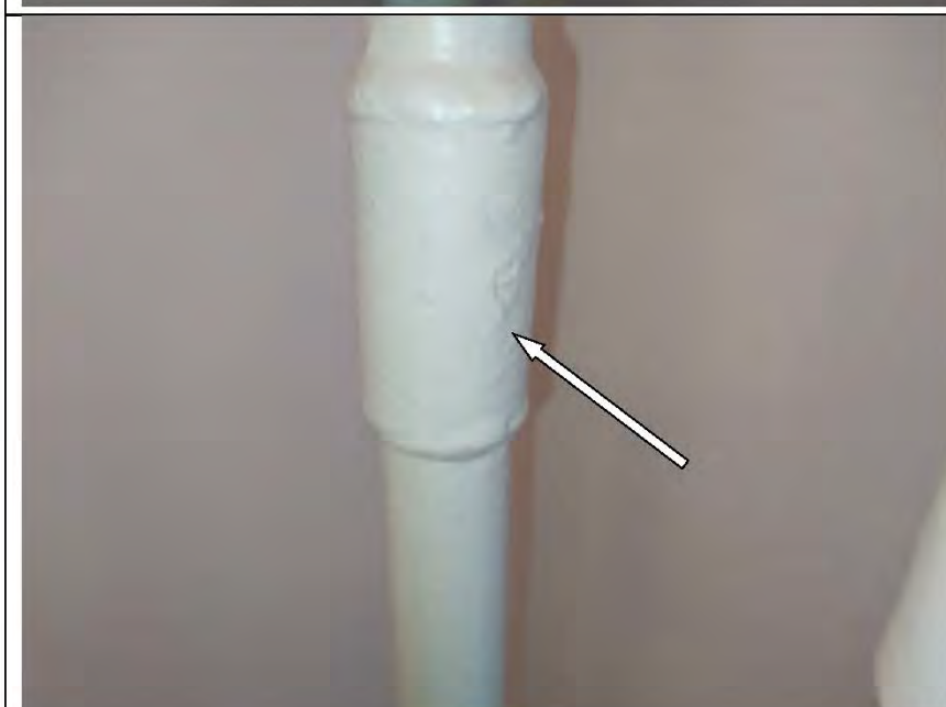
Фото №66. Окрашивание труб отопления в кухне выполнено с дефектами (подтеки).
