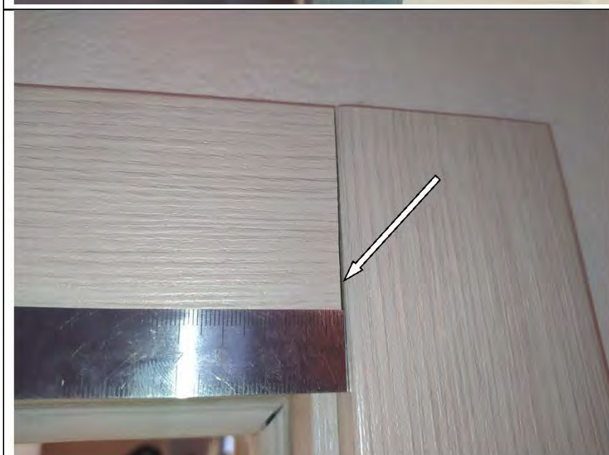
Фото №48. Элементы дверного блока соединены не надежно в гостиной.
