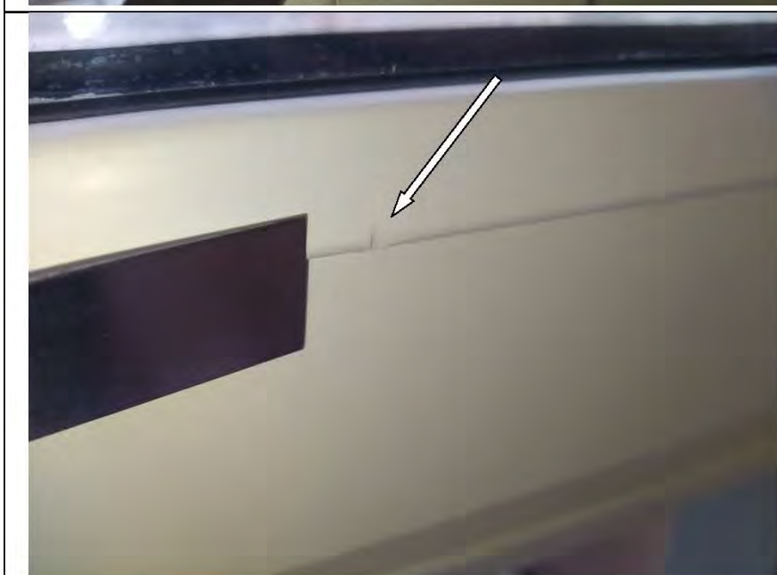
Фото №30. Профиль ПВХ оконного блока №4 в кухне имеет дефекты (скол).
