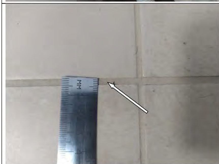
Фото №75. Затирка напольной плитки выполнена с нарушениями в ванной комнате (различие ширины шва).
