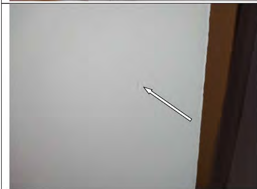
Фото №18. Раковины на окрашенной поверхности откосов оконного блока в спальне.
