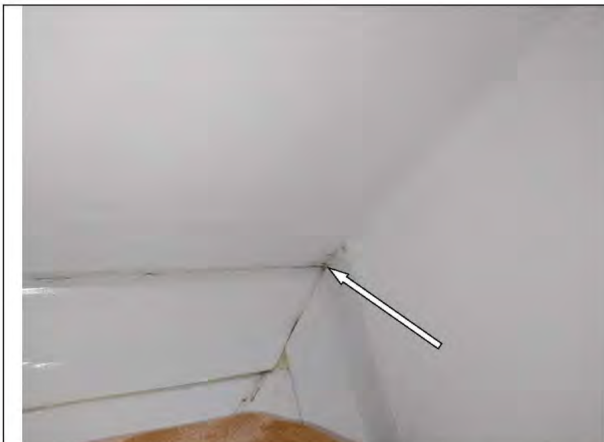
Фото №25. Оконный блок №2 в гостиной имеет щели, через которые происходит инфильтрация воздуха внутрь помещения.
