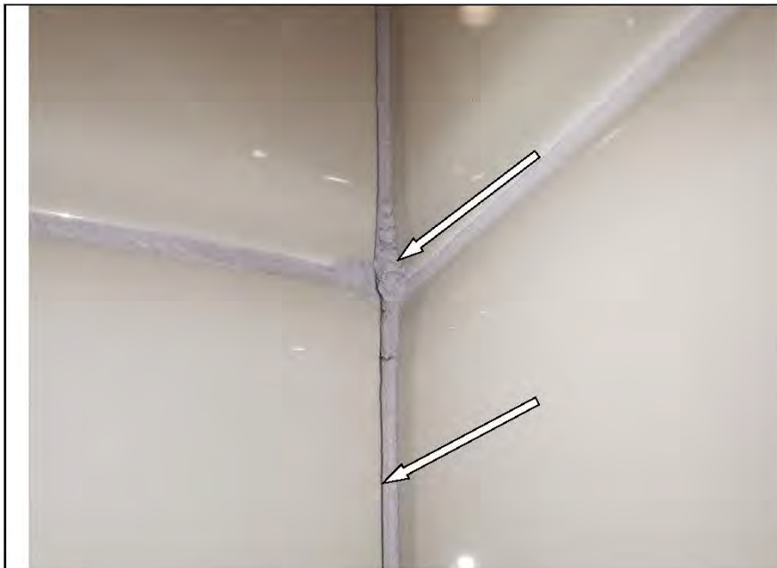
Фото №34. Затирка настенной плитки в ванной комнате выполнена с нарушениями.
