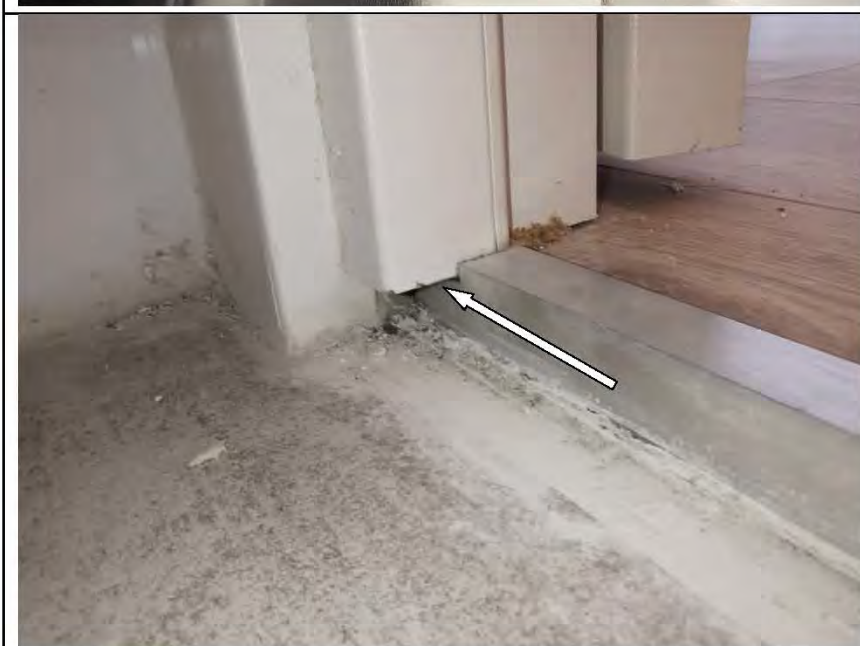
Фото №99. Коротко подрезан короб деревянного дверного блока в ванной комнате.
