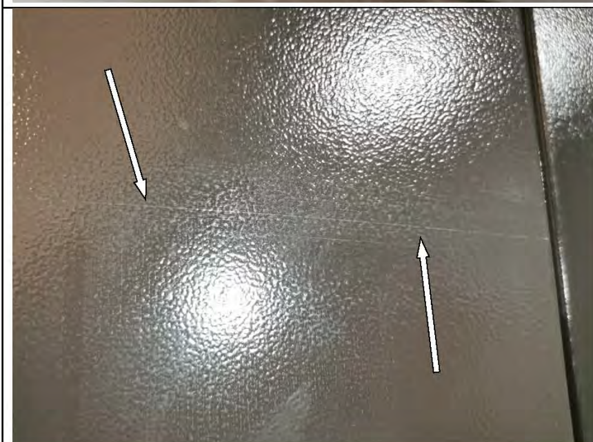
Фото №86. Царапины на полотне входного дверного блока.
