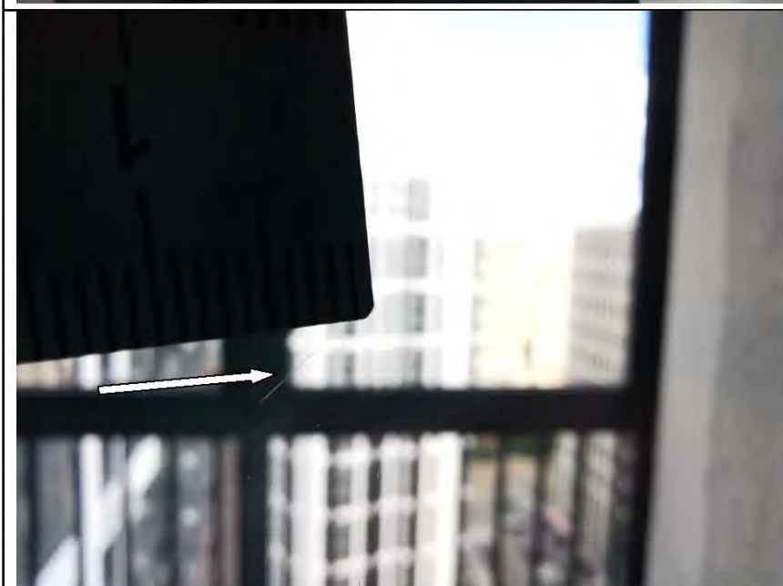
Фото №74. Царапины на стеклопакете балконного блока ПВХ в спальне.
