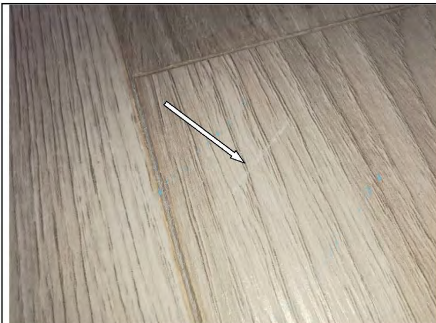
Фото №55. Царапины на ламинате в спальне.
