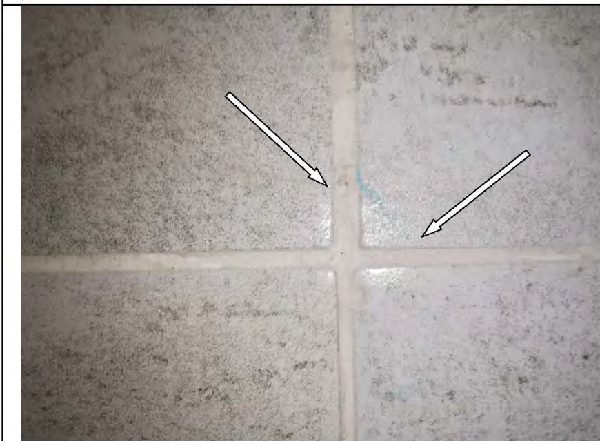
Фото №47. Затирка напольной плитки выполнена с нарушениями в санузле.
