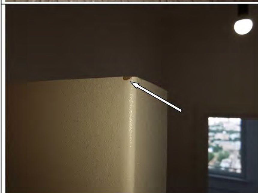
Фото №90. Сколы на полотне деревянного дверного блока в ванной комнате.
