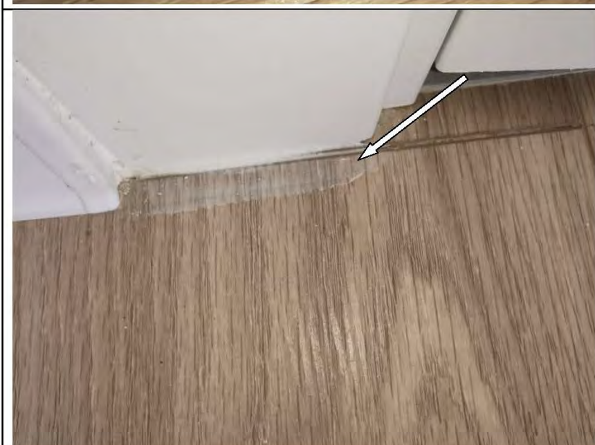
Фото №54. Загрязнение ламината в спальне.
