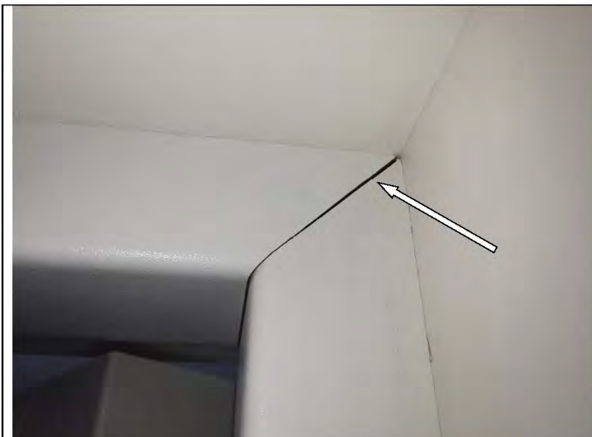
Фото №97. Ненадежное соединение элементов короба деревянного дверного блока в спальне.
