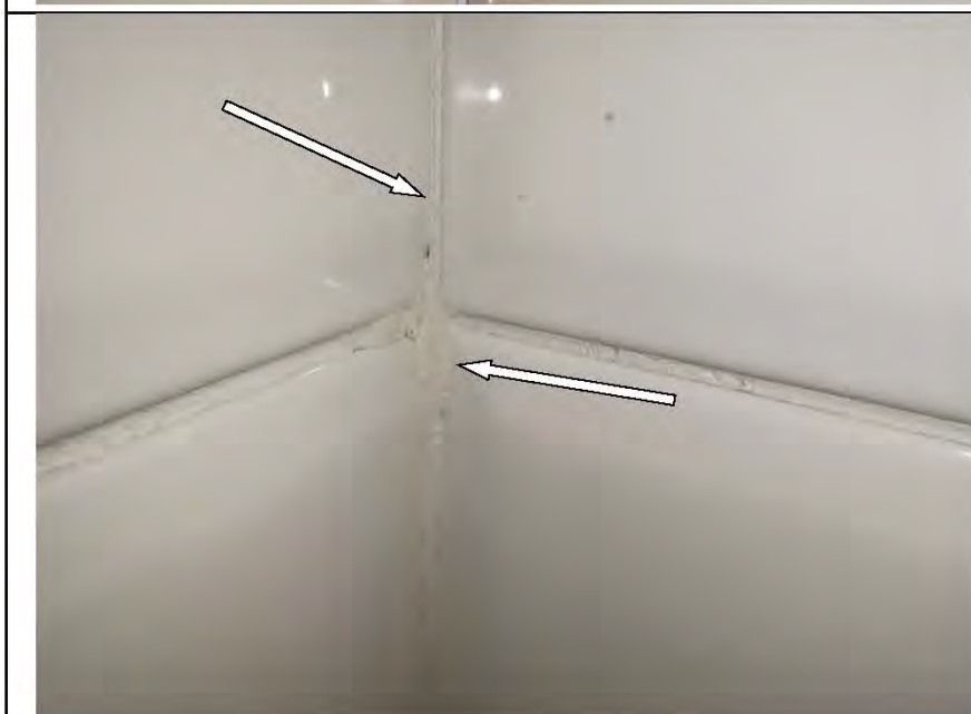
Фото №36. Затирка настенной плитки в санузле выполнена с нарушениями.
