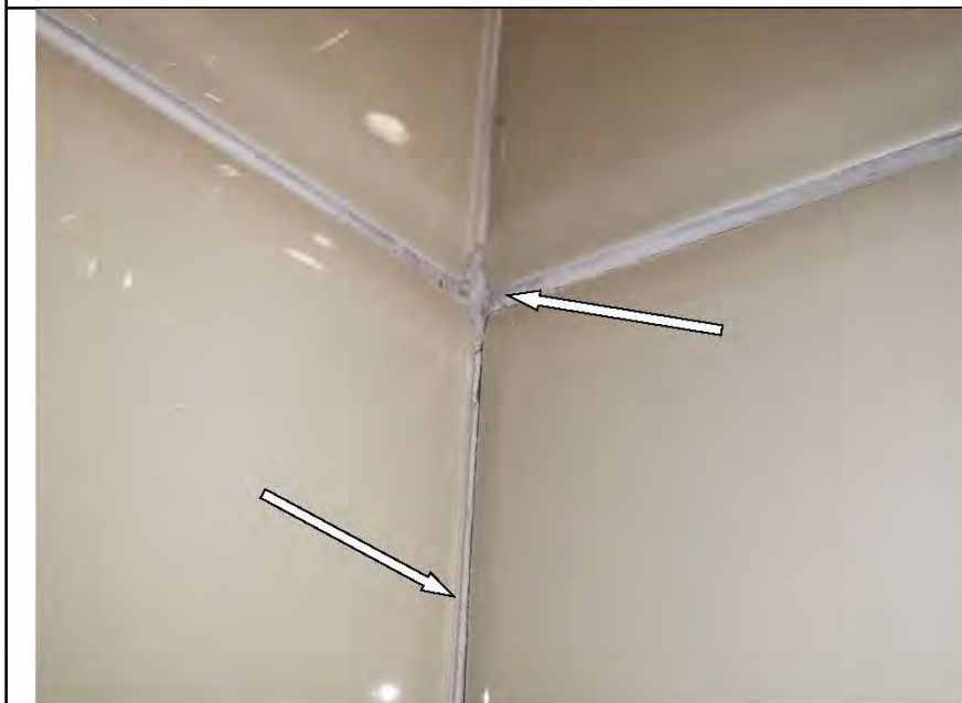
Фото №35. Затирка настенной плитки в санузле выполнена с нарушениями.
