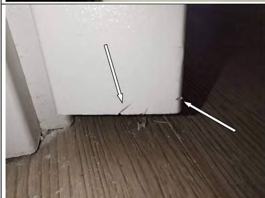
Фото №89. Царапины и сколы на полотне деревянного дверного блока в ванной комнате.
