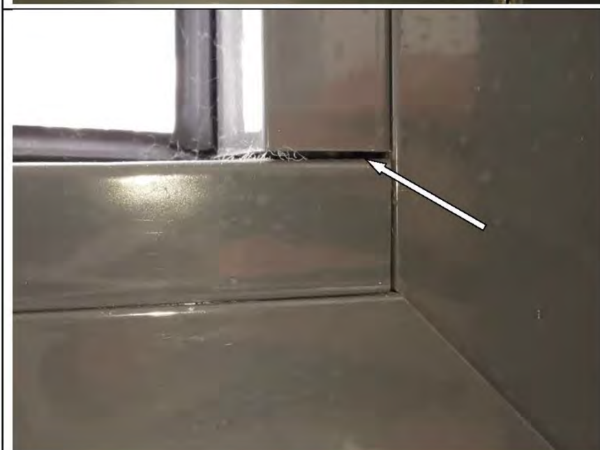
Фото №80. Зазор в месте стыка профилей металлического оконного блока на лоджии.
