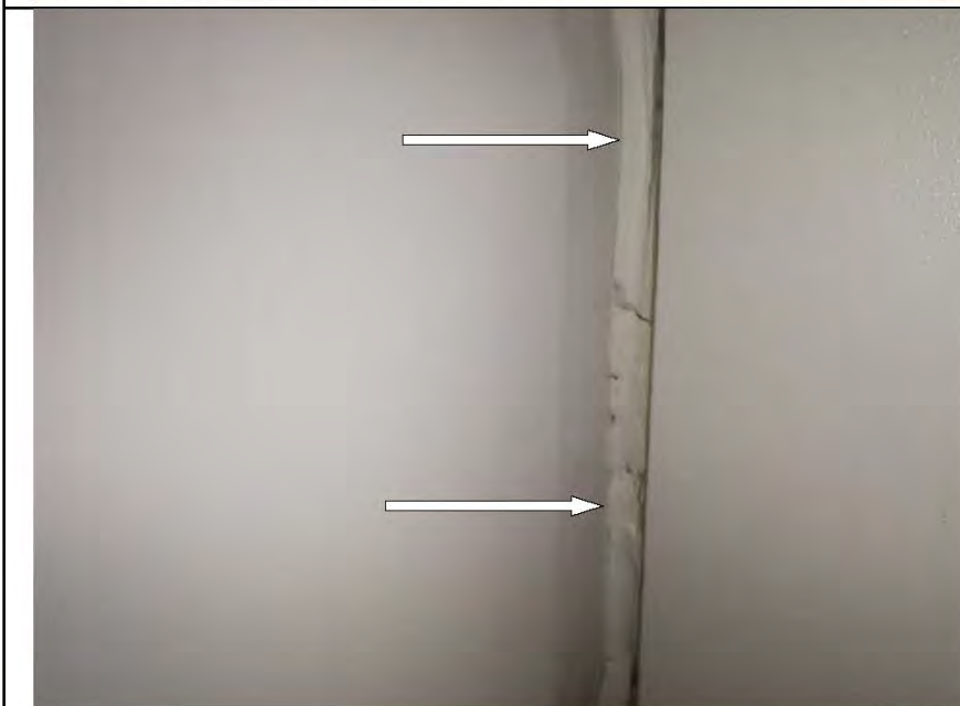
Фото №32. Затирка настенной плитки в ванной комнате выполнена с нарушениями.
