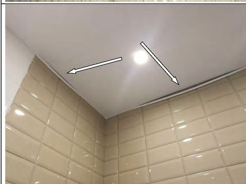
Фото №56. Дефект монтажа декоративного молдинга крепления натяжного потолка в ванной комнате.
