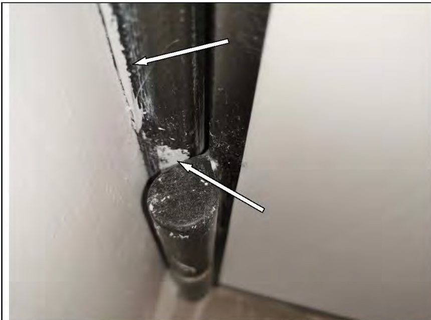
Фото №85. Загрязнение на коробе входного дверного блока.
