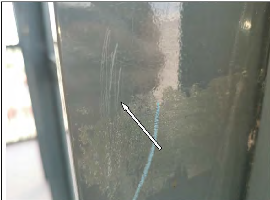
Фото №76. Царапины на профиле металлического оконного блока на лоджии.
