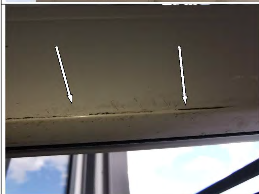
Фото №63. Потертости на профиле ПВХ оконного блока в кухне.
