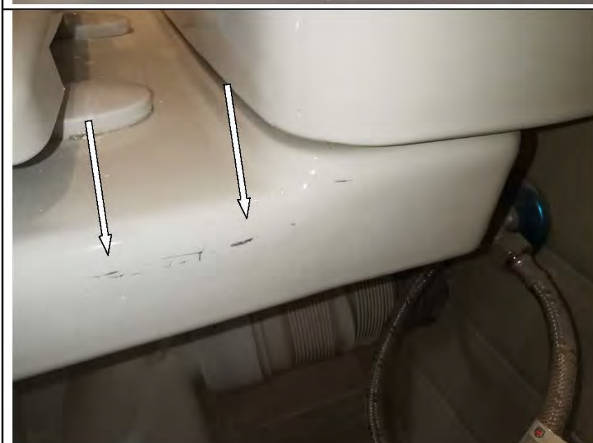
Фото №60. Загрязнение унитаза в санузле.
