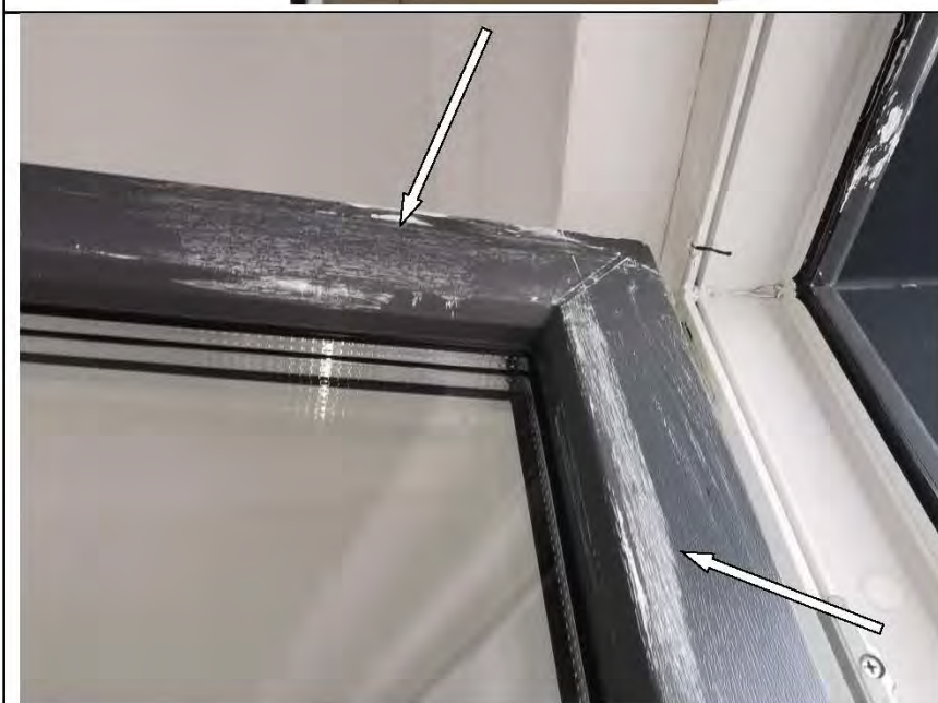
Фото №66. Загрязнение профиля ПВХ оконного блока в кухне.
