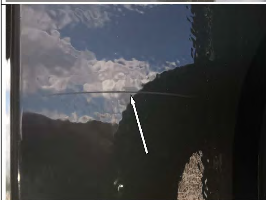
Фото №78. Царапины на профиле металлического оконного блока на лоджии.
