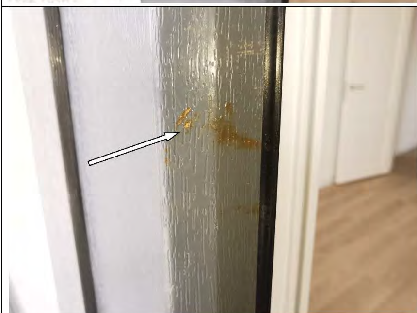
Фото №69. Загрязнение профиля ПВХ балконного блока в спальне.
