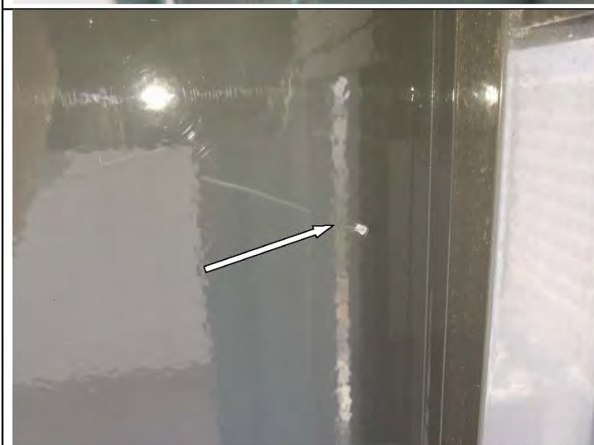
Фото №77. Царапины на профиле металлического оконного блока на лоджии.
