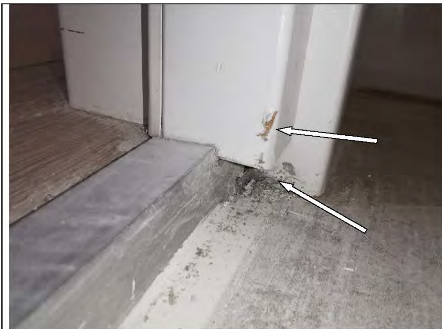
Фото №100. Коротко подрезан короб деревянного дверного блока, повреждение ламинации короба деревянного дверного блока в санузле.
