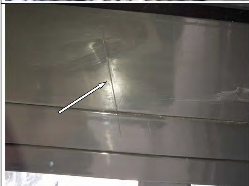
Фото №75. Царапины на профиле металлического оконного блока на лоджии.
