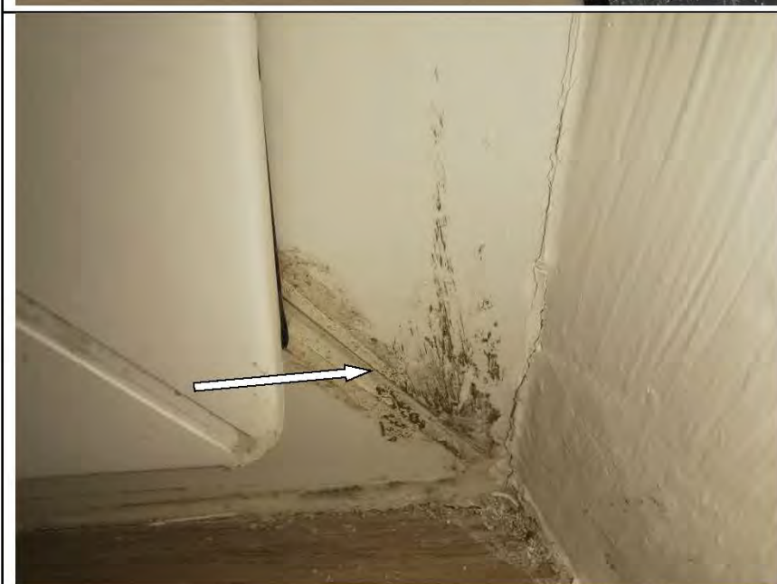
Фото №72. Загрязнение профиля ПВХ балконного блока в спальне.
