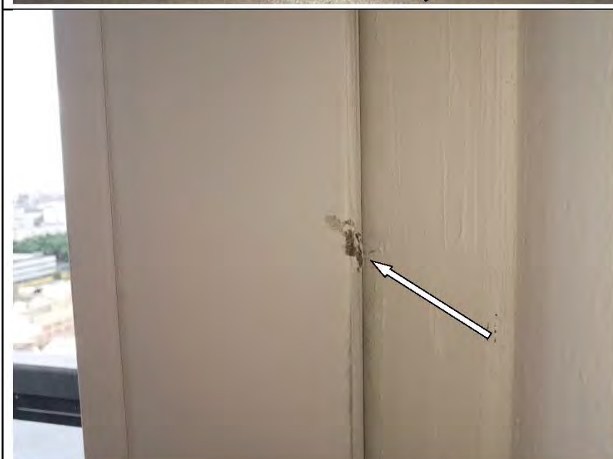
Фото №62. Загрязнение профиля ПВХ оконного блока в кухне.
