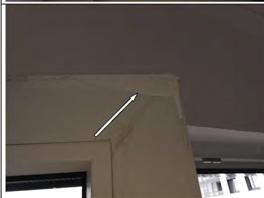
Фото №65. Загрязнение профиля ПВХ оконного блока в кухне.
