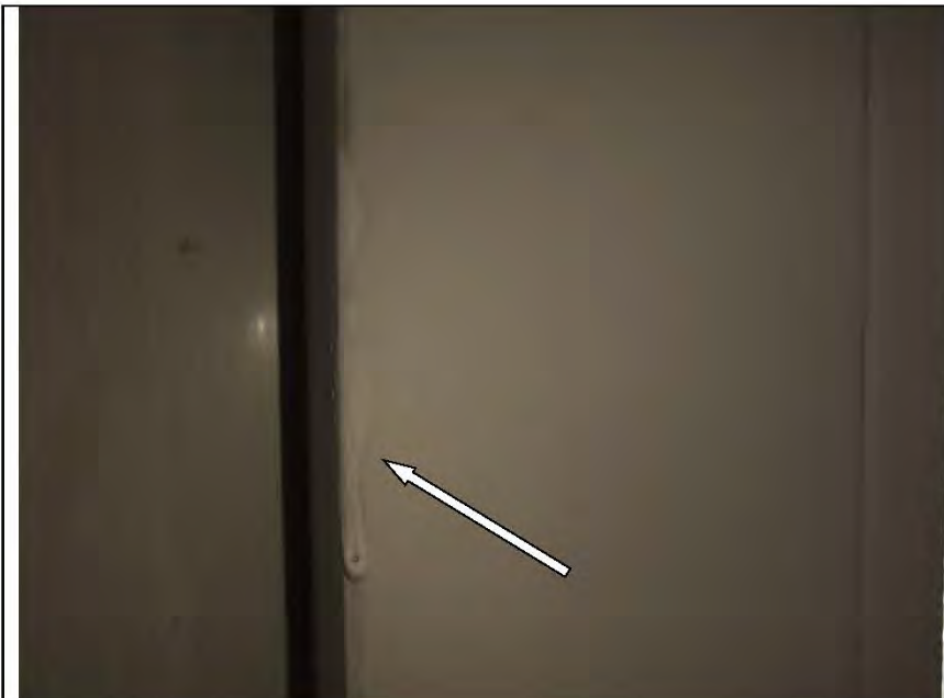
Фото №70. Загрязнение профиля ПВХ балконного блока в спальне.
