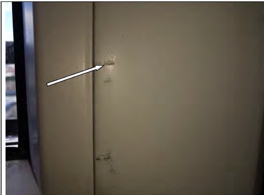
Фото №64. Потертости на профиле ПВХ оконного блока в кухне.
