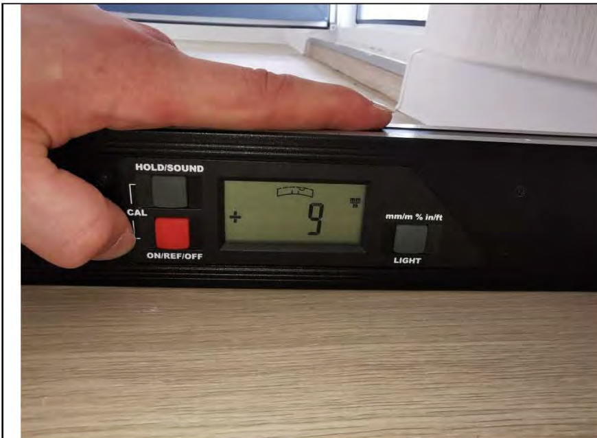
Фото №40. Измерение уровня пола в спальне.
