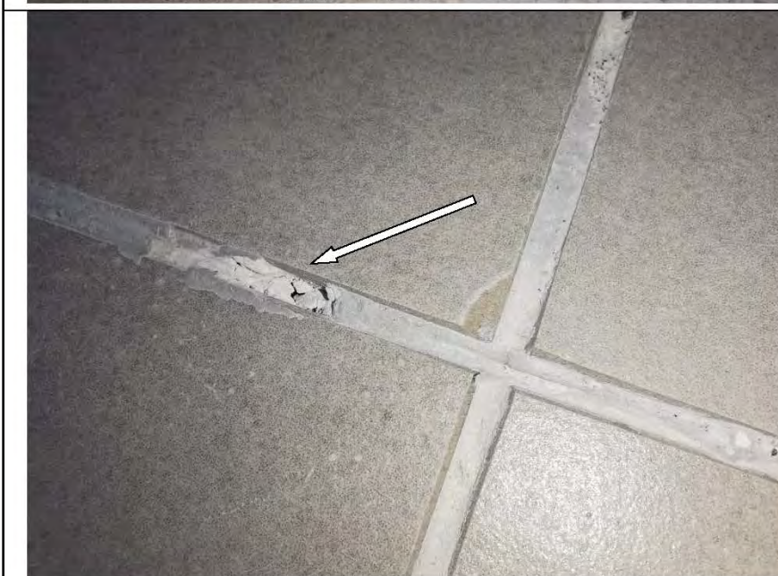
Фото №48. Затирка напольной плитки выполнена с нарушениями в кухне.
