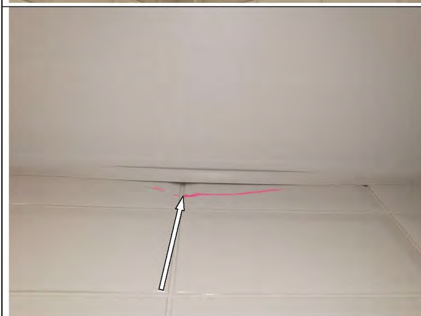
Фото №57. Дефект монтажа декоративного молдинга крепления натяжного потолка в санузле.
