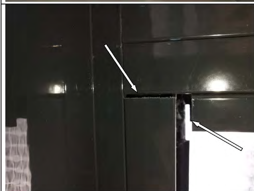
Фото №81. Зазор в месте стыка профилей металлического оконного блока на лоджии.
