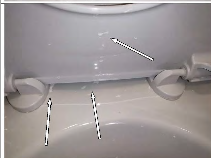
Фото №59. Загрязнение унитаза в санузле.
