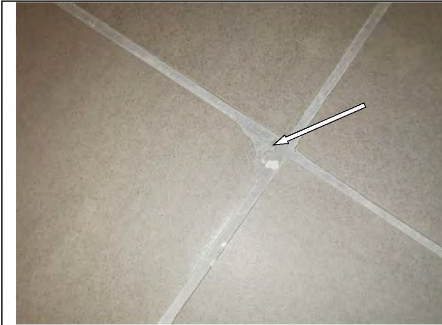
Фото №46. Затирка напольной плитки выполнена с нарушениями в прихожей.
