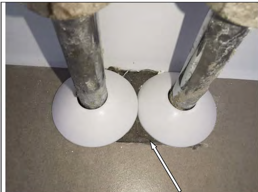
Фото №61. Заделка отверстия для трубопровода отопления в керамической плитке выполнена с дефектом в кухне.
