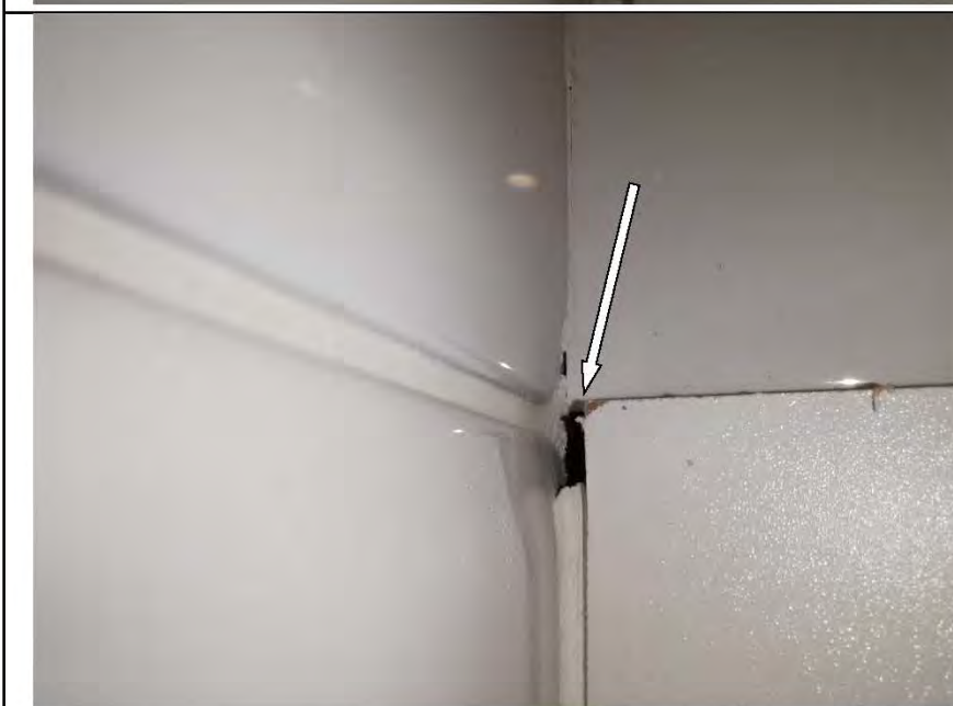
Фото №33. Затирка настенной плитки в ванной комнате выполнена с нарушениями.
