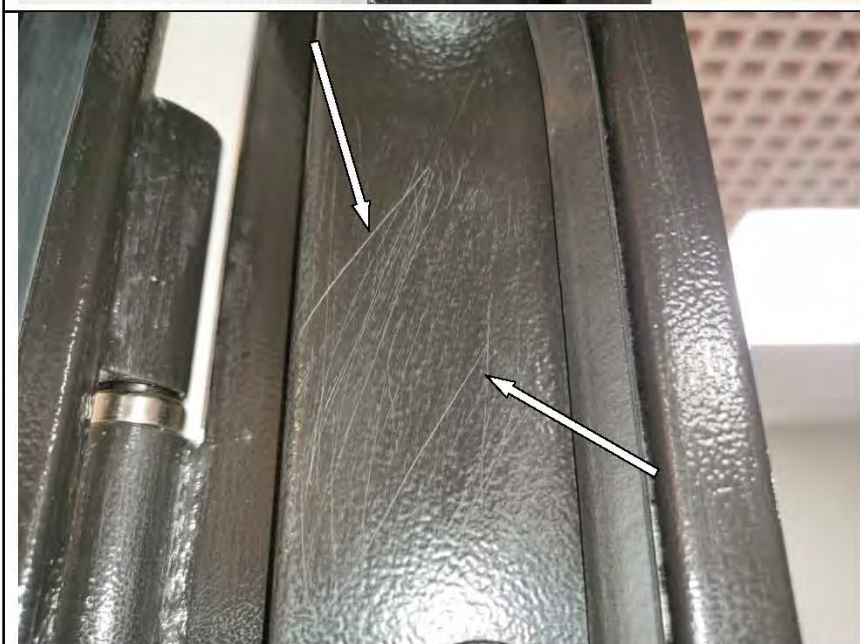
Фото №84. Царапины на коробе входного дверного блока.
