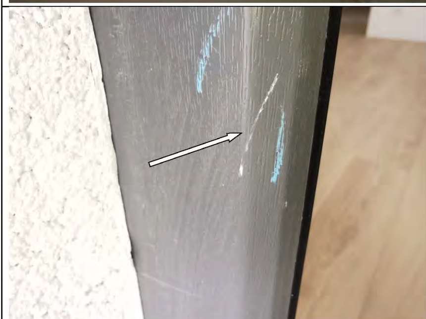
Фото №68. Царапины на профиле балконного блока ПВХ в спальне.
