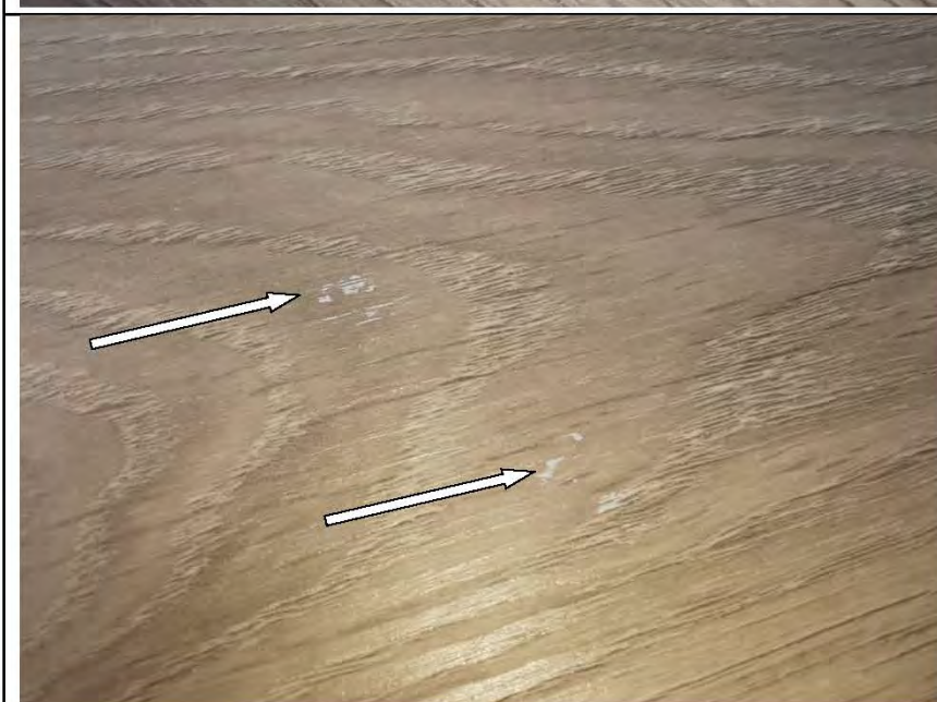
Фото №53. Загрязнение ламината в гостиной.
