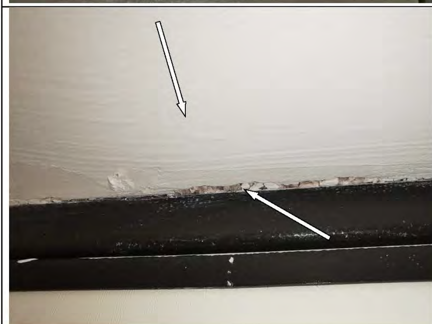
Фото №87. Окрашенные откосы входного дверного блока выполнены с дефектами.
