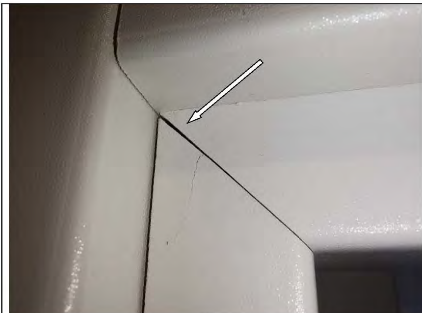
Фото №91. Ненадежное соединение элементов короба деревянного дверного блока в санузле.
