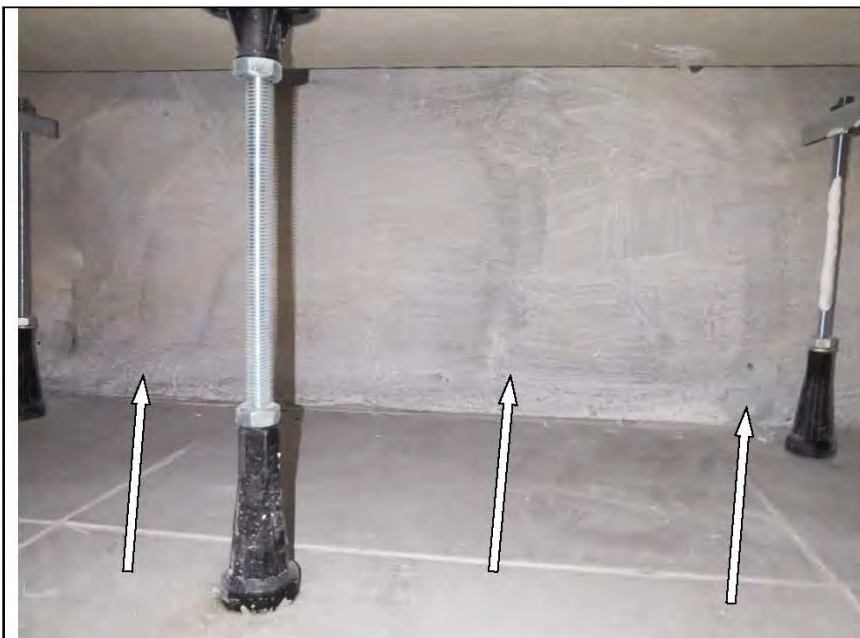
Фото №58. Некачественно выполнена гидроизоляция в ванной комнате.
