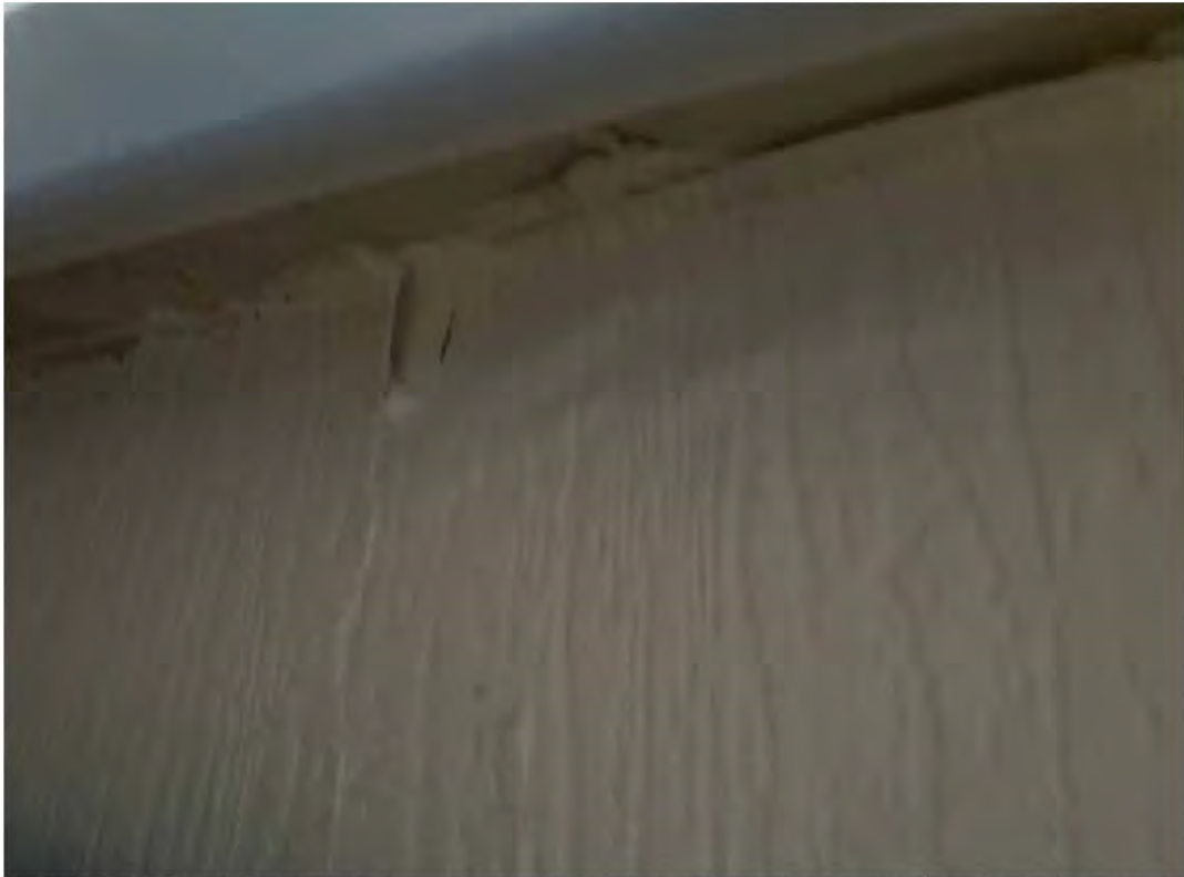
2.4 Локальные участки имеют: замятины, пятна, загрязнения, отслоения обоев, неровности под обоями (Комната 1)
