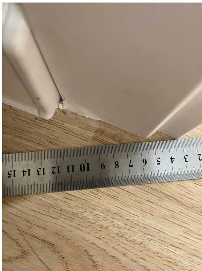
2.1 На дверном блоке имеются: сколы и отслоения ламинации (Комната 1)
