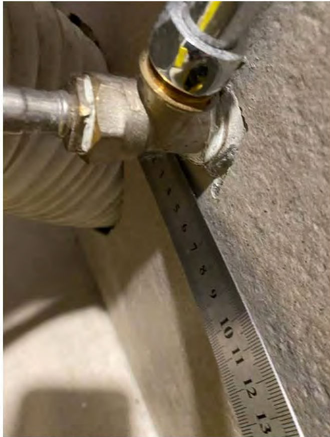
5.3 Скол на настенной плитке (Санузел)
