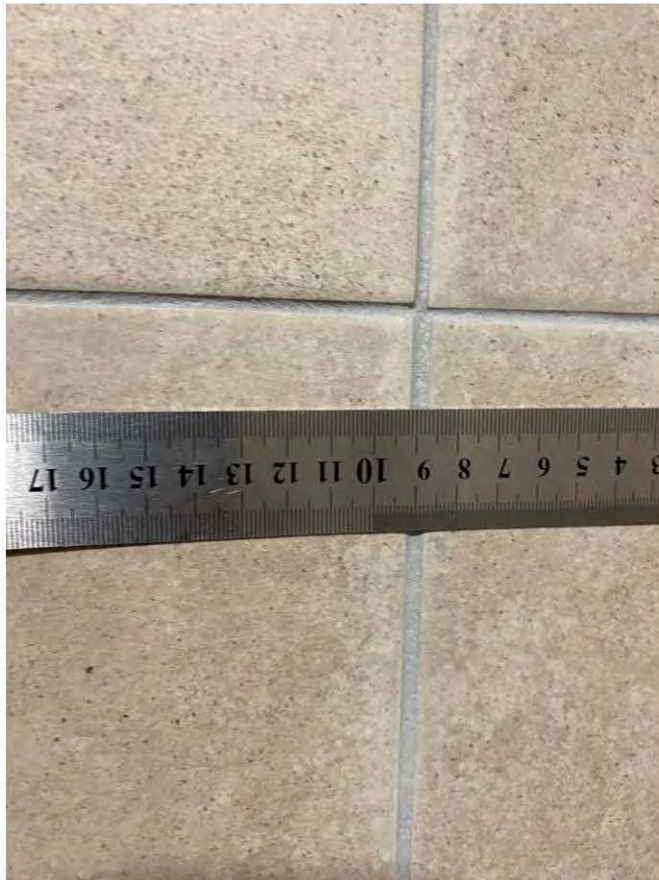
5.4 Отклонение ширины шва на 1,5 мм на настенной плитке (Санузел)
