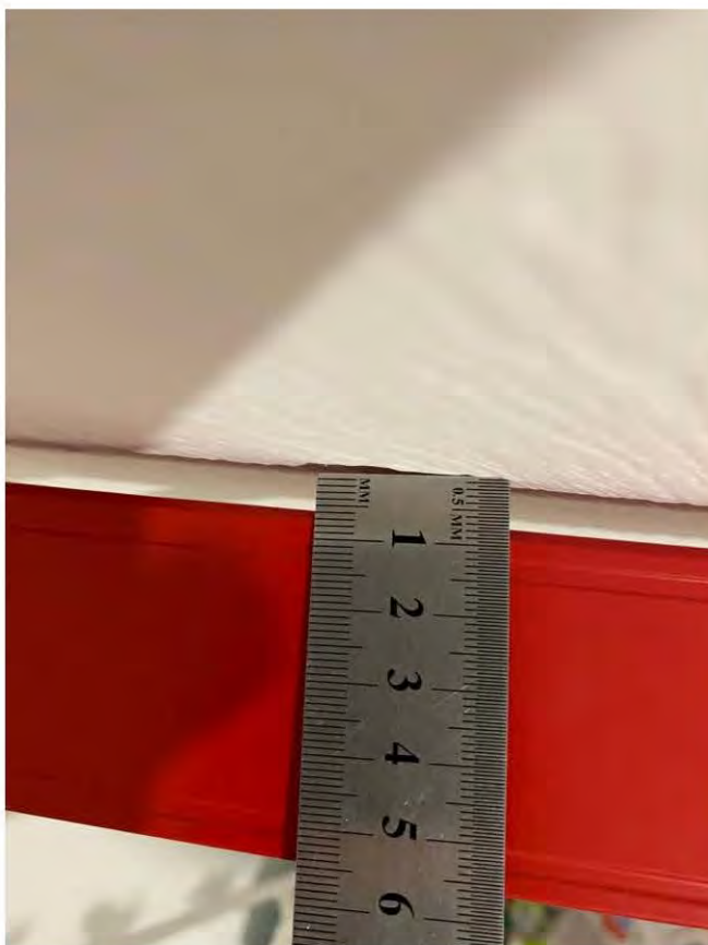
2.10 Отклонения участка стены от горизонтали 6 мм (Комната 1)
