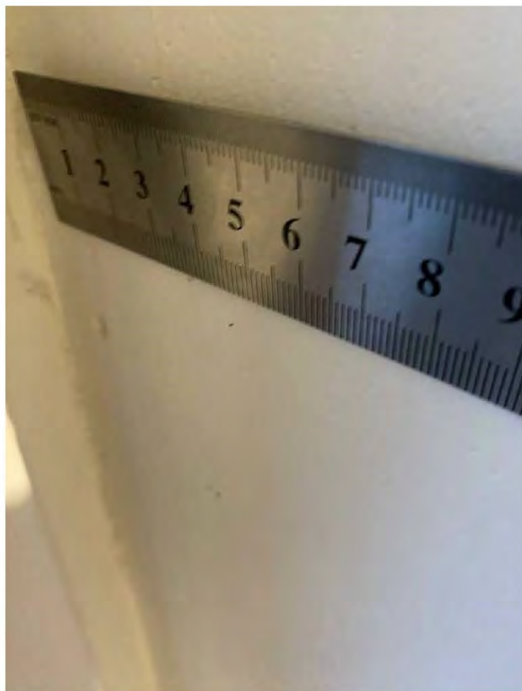
2.6 Некачественная окраска оконных откосов (Комната 1)
