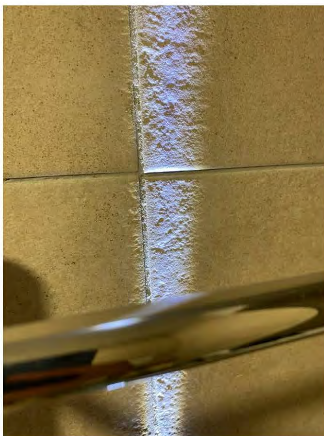
5.2 Отклонение шва настенной плитки от горизонтали 2,5 мм (Санузел)
