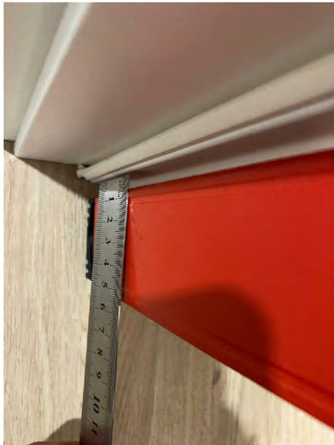
2.3 Отклонение дверной коробки от плоскости 7 мм (Комната 1)
