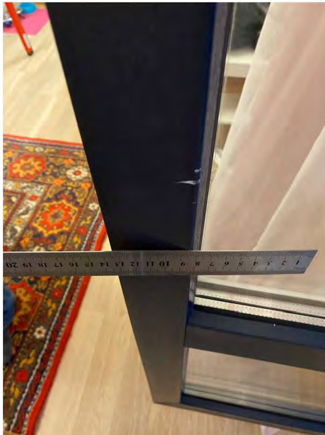
3.4 Множественные повреждения на оконном блоке: царапины, сколы (Кухня)
