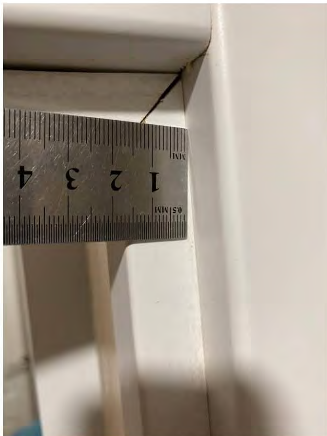
5.1 На дверном блоке имеется зазор 2 мм между смежными элементами в результате криволинейного монтажа (Санузел)
