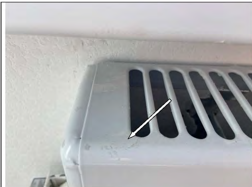
Фото №91. Дефект на металлическом кожухе отопительного прибора в спальне.
