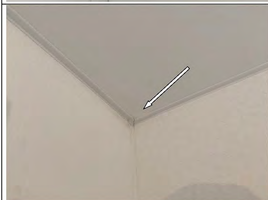
Фото №86. Дефект на поверхности натяжного потолка в коридоре.
