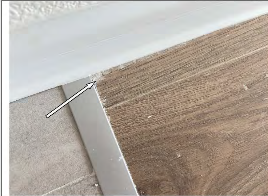
Фото №43. Дефект на напольном покрытии из ламината в кухне.
