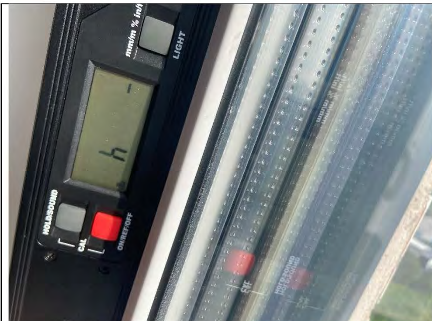
Фото №64. Отклонения от вертикали оконного блока ПВХ в спальне.
