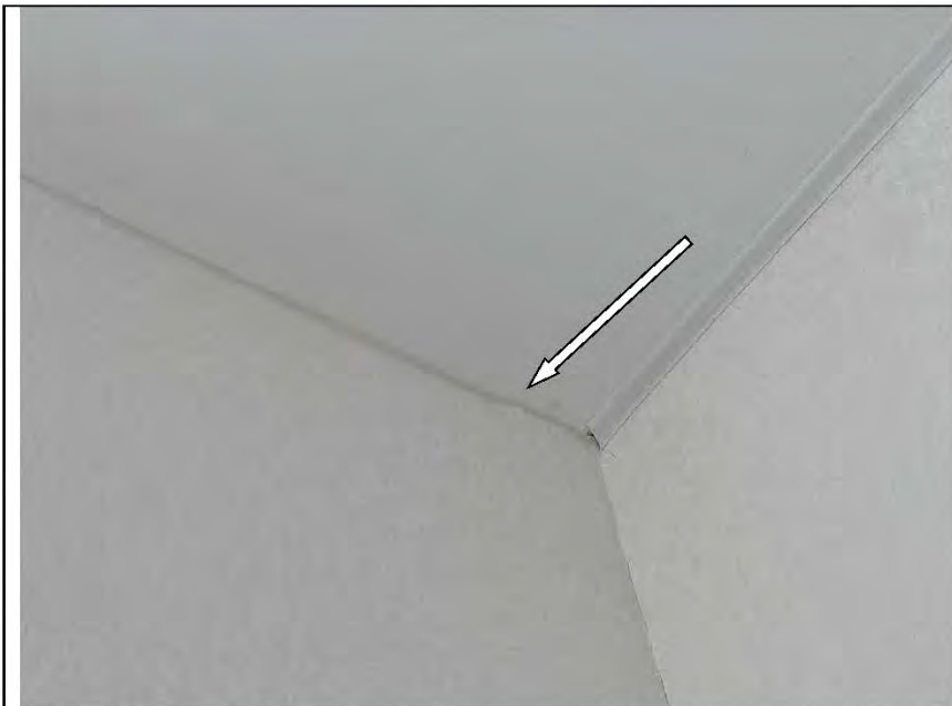
Фото №88. Дефект на поверхности натяжного потолка в спальне.
