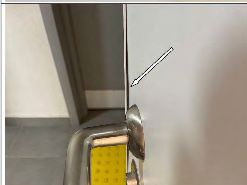
Фото №71. Дефект на полотне входного дверного блока в коридоре.
