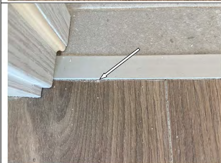
Фото №45. Дефект на напольном покрытии из ламината в кабинете.
