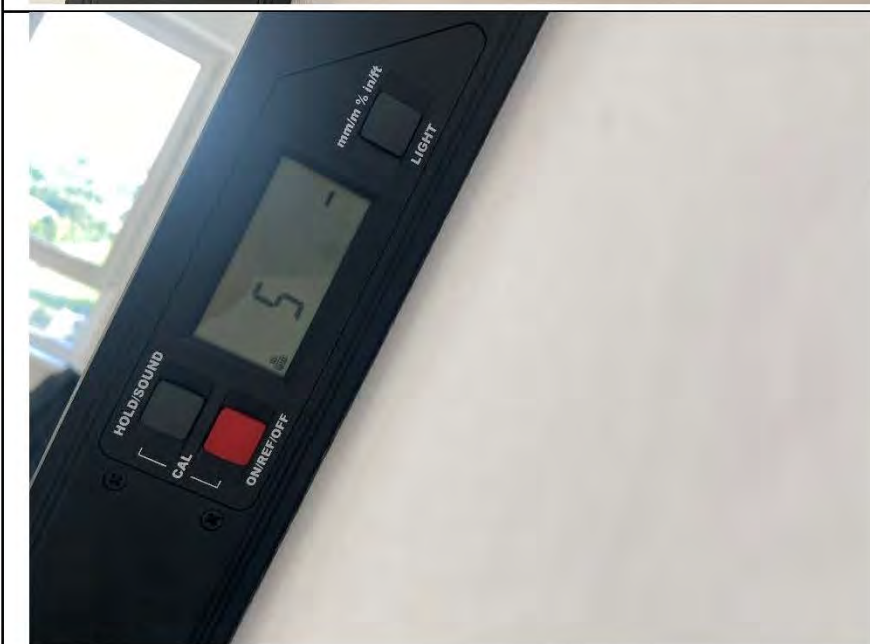
Фото №9. Отклонения поверхности стен от вертикали в кухне.
