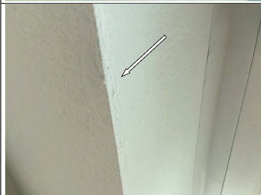
Фото №62. Неровности, выбоины, раковины на окрашенных откосах оконного блока ПВХ в кабинете.
