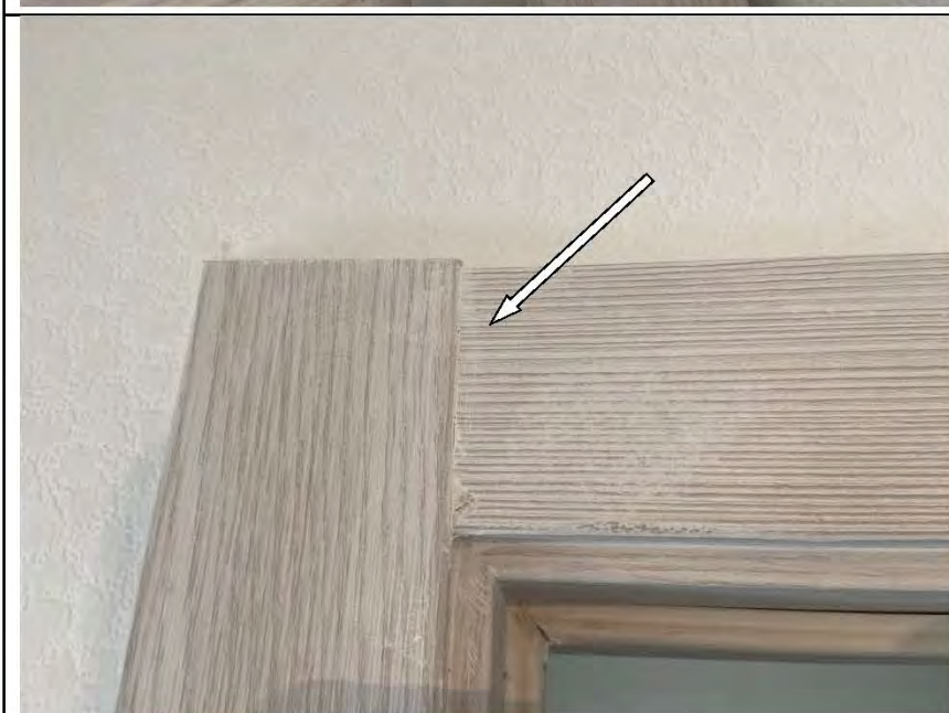
Фото №78. Дефект на наличниках деревянного дверного блока в ванной комнате.
