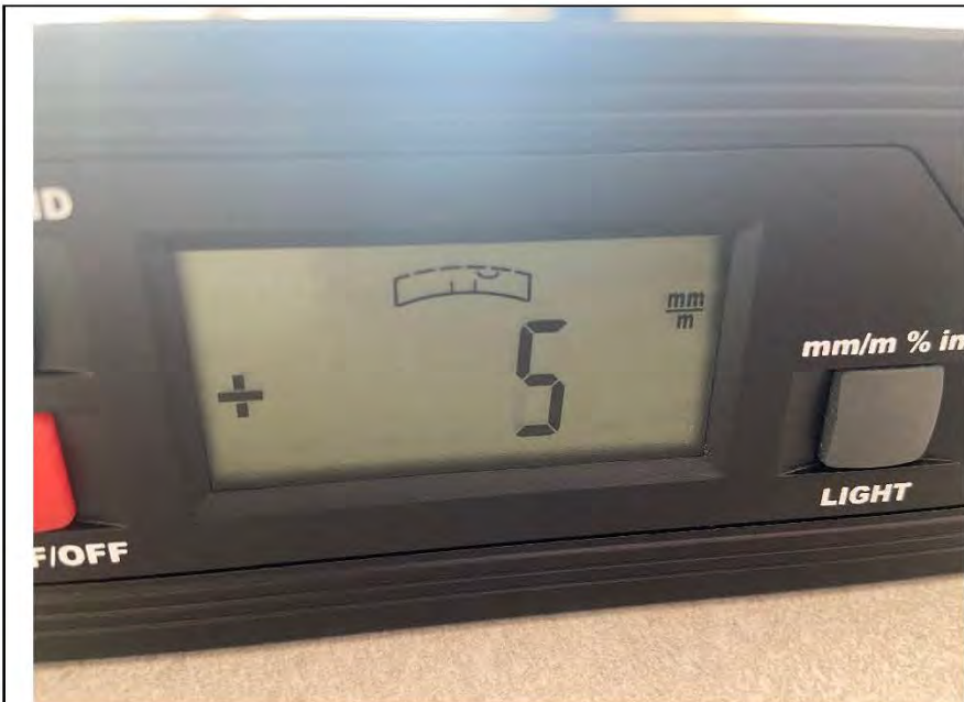
Фото №28. Отклонения поверхности напольного покрытия из керамической плитки в кухне.
