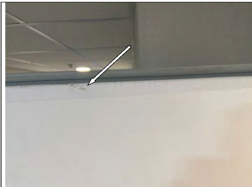
Фото №70. Дефект на полотне входного дверного блока в коридоре.
