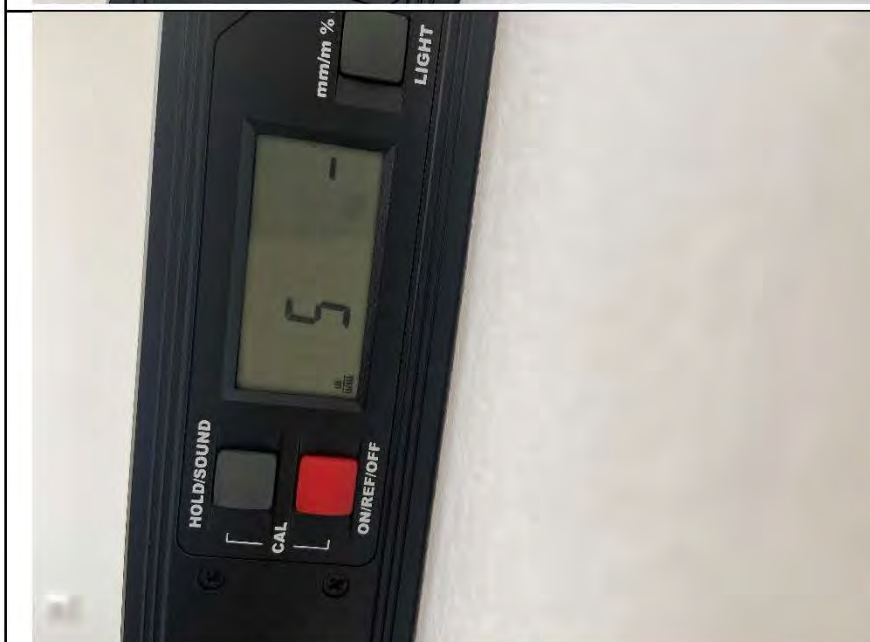
Фото №11. Отклонения поверхности стен от вертикали в кабинете.
