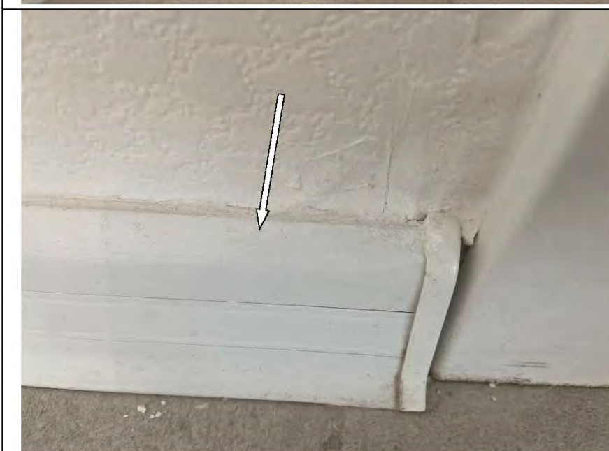
Фото №39. Дефект на напольном плинтусе ПВХ в коридоре.
