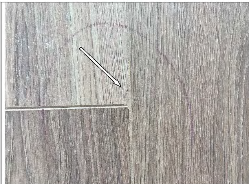
Фото №49. Скол на поверхности напольного покрытия из ламината в кухне.
