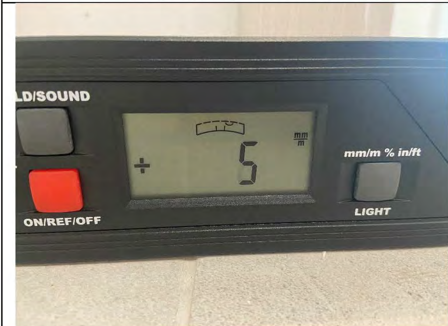
Фото №29. Отклонения поверхности напольного покрытия из керамической плитки в санузле.
