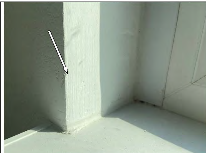
Фото №61. Неровности, выбоины, раковины на окрашенных откосах оконного блока ПВХ в спальне.
