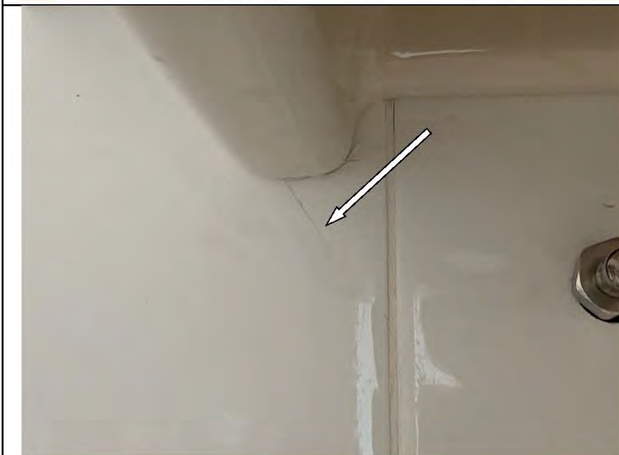
Фото №14. Трещина на настенной керамической плитке в ванной комнате.
