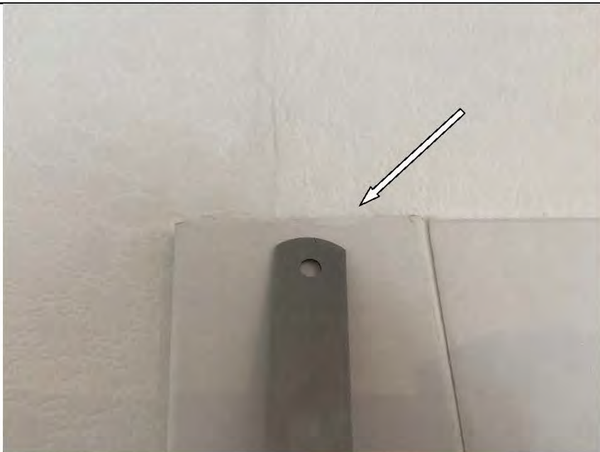
Фото №75. Дефект на наличниках входного дверного блока в коридоре.
