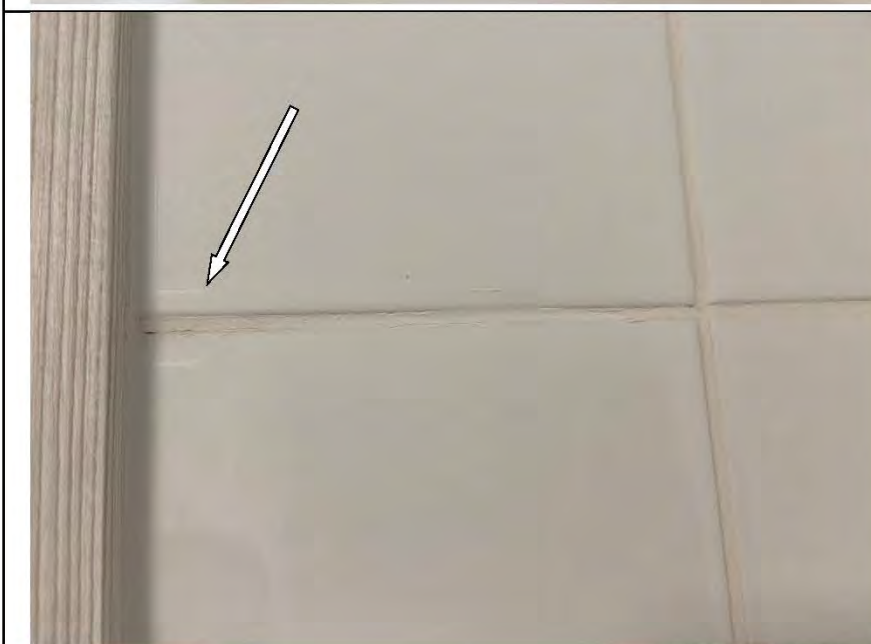
Фото №18. Загрязнения на настенной керамической плитке в ванной комнате.
