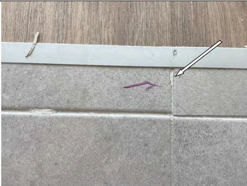
Фото №47. Механическое повреждение на поверхности напольного покрытия из керамической плитки в коридоре.
