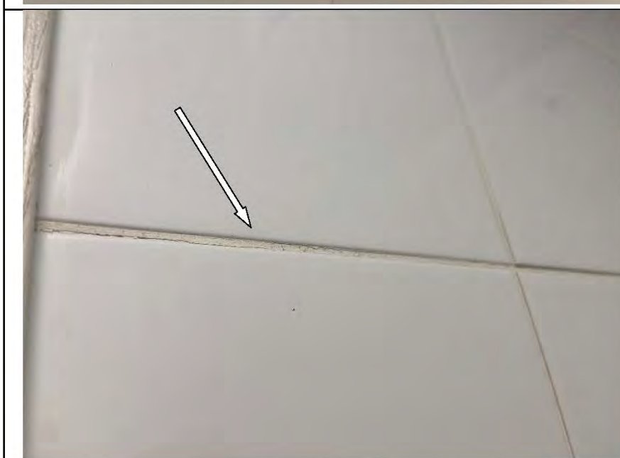
Фото №21. Неровные швы настенной керамической плитки в санузле.
