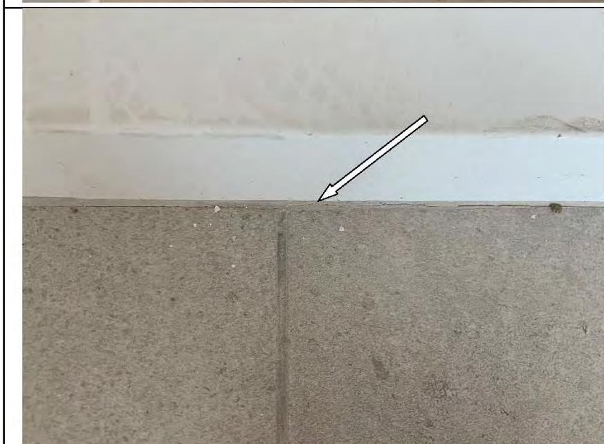
Фото №35. Неровные швы напольной керамической плитки в коридоре.
