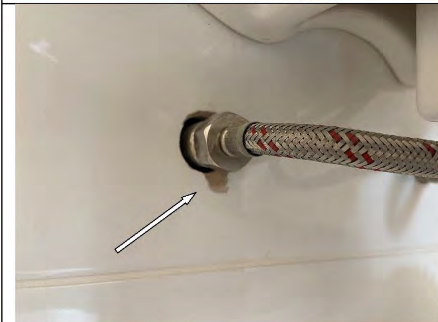
Фото №17. Скол на настенной керамической плитке в санузле.
