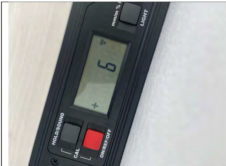
Фото №10. Отклонения поверхности стен от вертикали в спальне.
