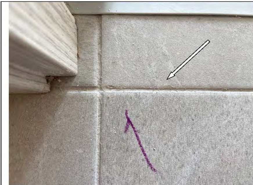
Фото №31. Загрязнения на напольной керамической плитке в коридоре.
