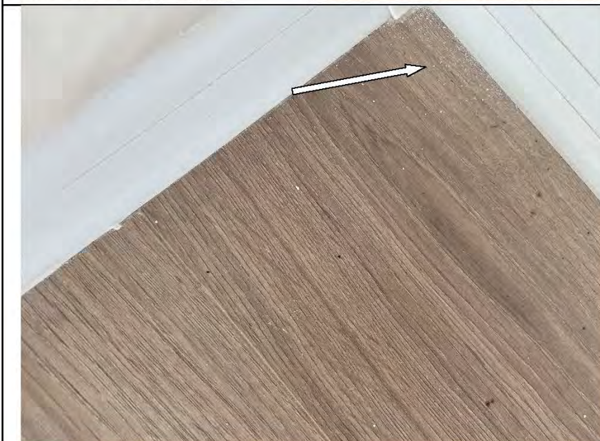
Фото №44. Дефект на напольном покрытии из ламината в спальне.
