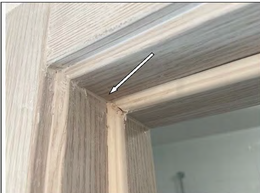
Фото №82. Дефект на коробке деревянного дверного блока в ванной комнате.
