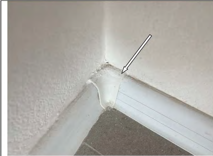
Фото №40. Дефект на напольном плинтусе ПВХ в кухне.
