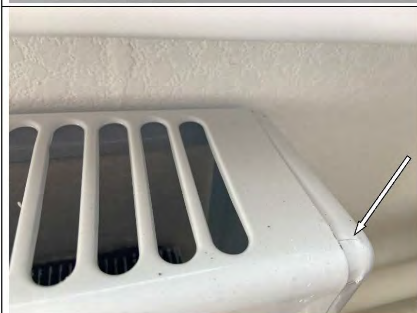
Фото №90. Дефект на металлическом кожухе отопительного прибора в кухне.
