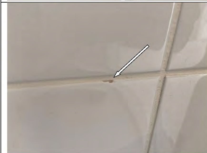
Фото №15. Скол на настенной керамической плитке в ванной комнате.
