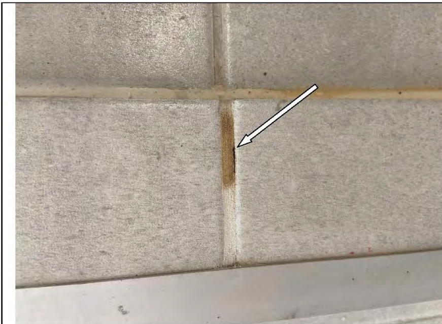
Фото №37. Неровные швы напольной керамической плитки в ванной комнате.
