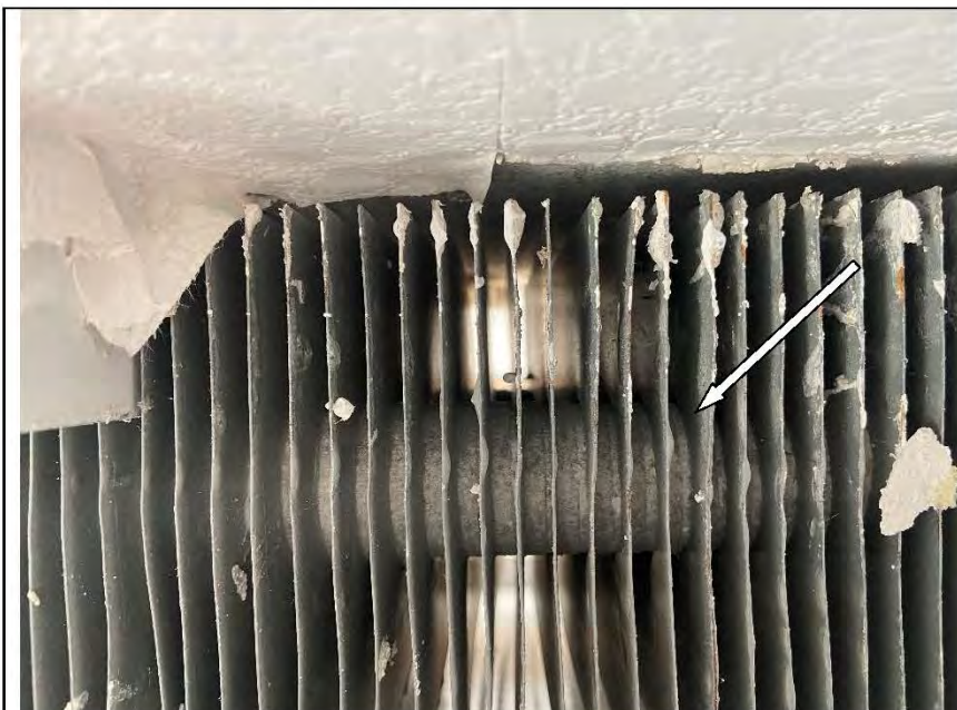
Фото №94. Замятие на радиаторе в спальне.
