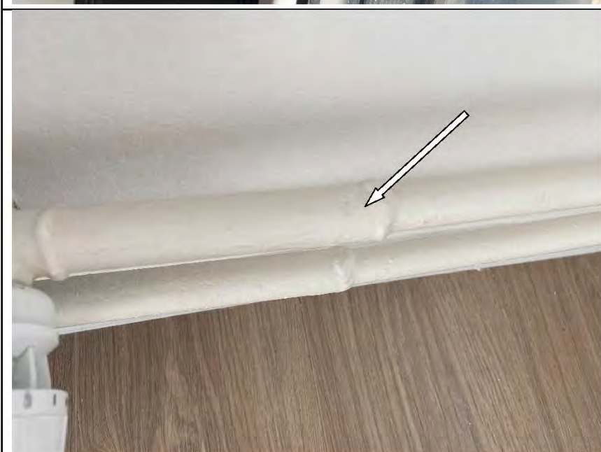
Фото №66. Неровности, подтеки на окрашенных трубах отопления в спальне.
