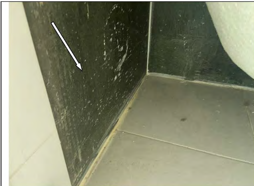
Фото №22. Частично отсутствует настенная керамическая плитка в ванной комнате.
