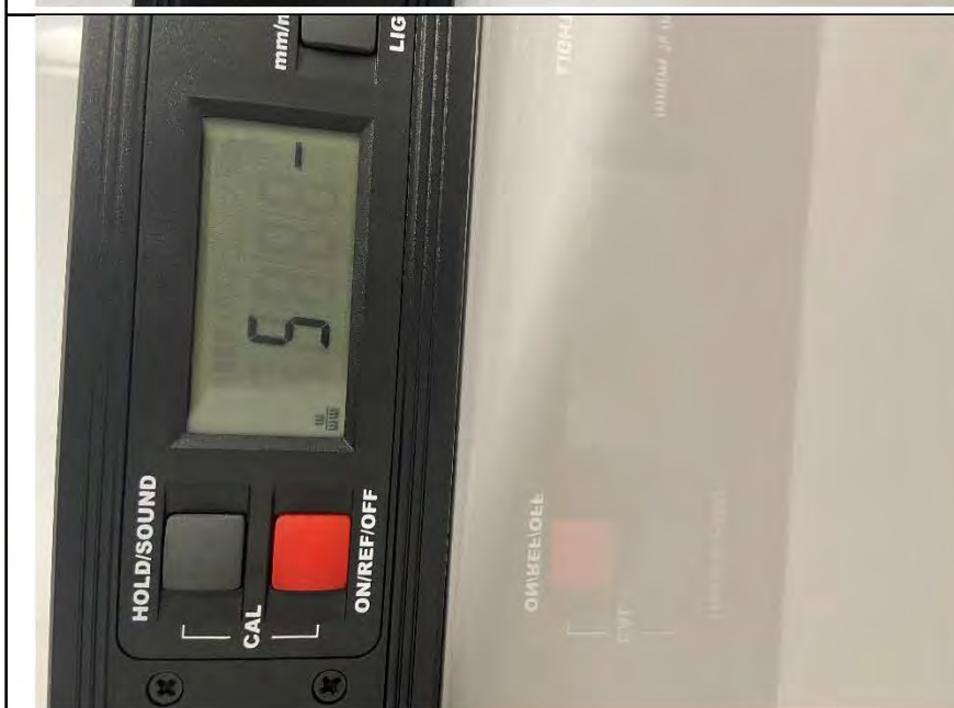
Фото №12. Отклонения поверхности стен от вертикали в санузле.
