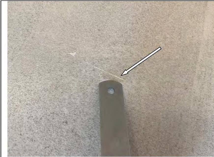
Фото №46. Механическое повреждение на поверхности напольного покрытия из керамической плитки в коридоре.
