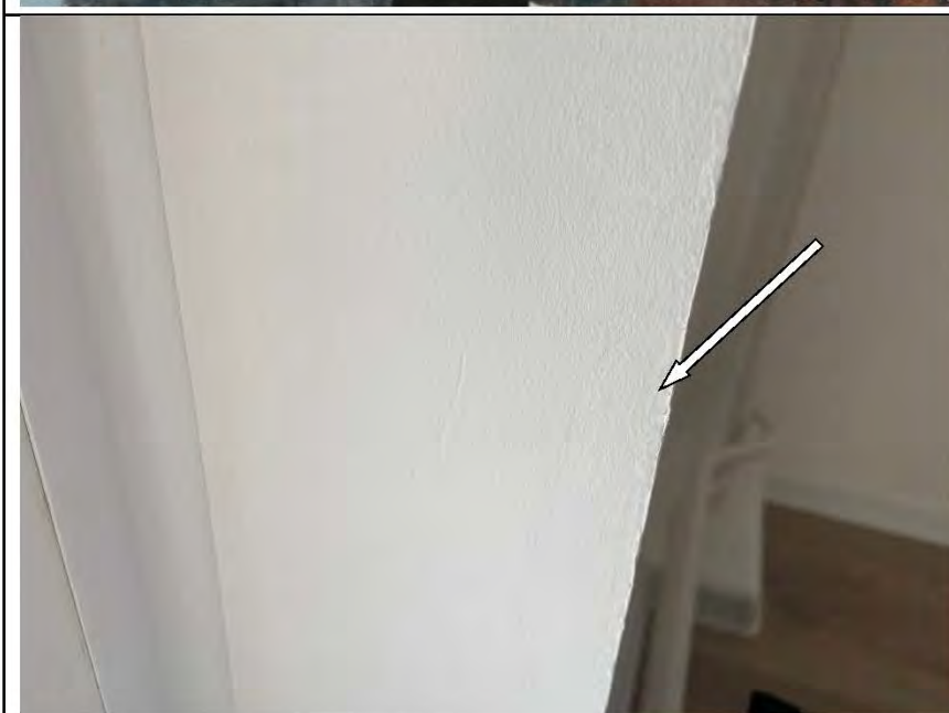
Фото №60. Неровности, выбоины, раковины на окрашенных откосах оконного блока ПВХ в кухне.
