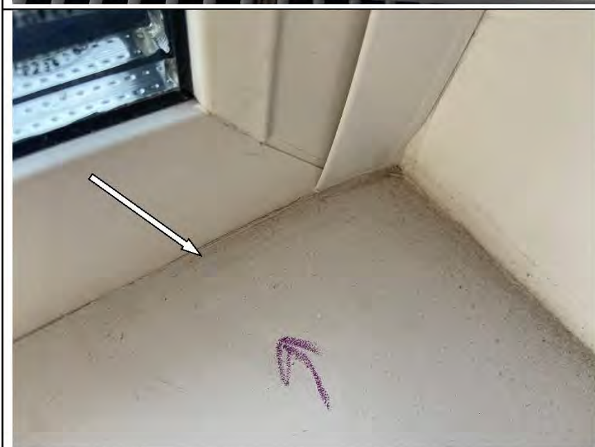
Фото №51. Дефект на лицевой стороне подоконной доски оконного блока ПВХ в спальне.
