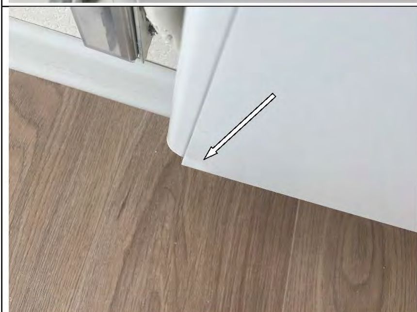
Фото №92. Дефект на металлическом кожухе отопительного прибора в кабинете.
