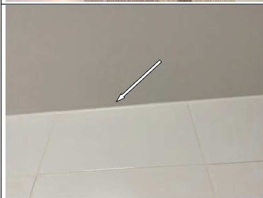
Фото №84. Дефект на поверхности подвесного потолка в ванной комнате.
