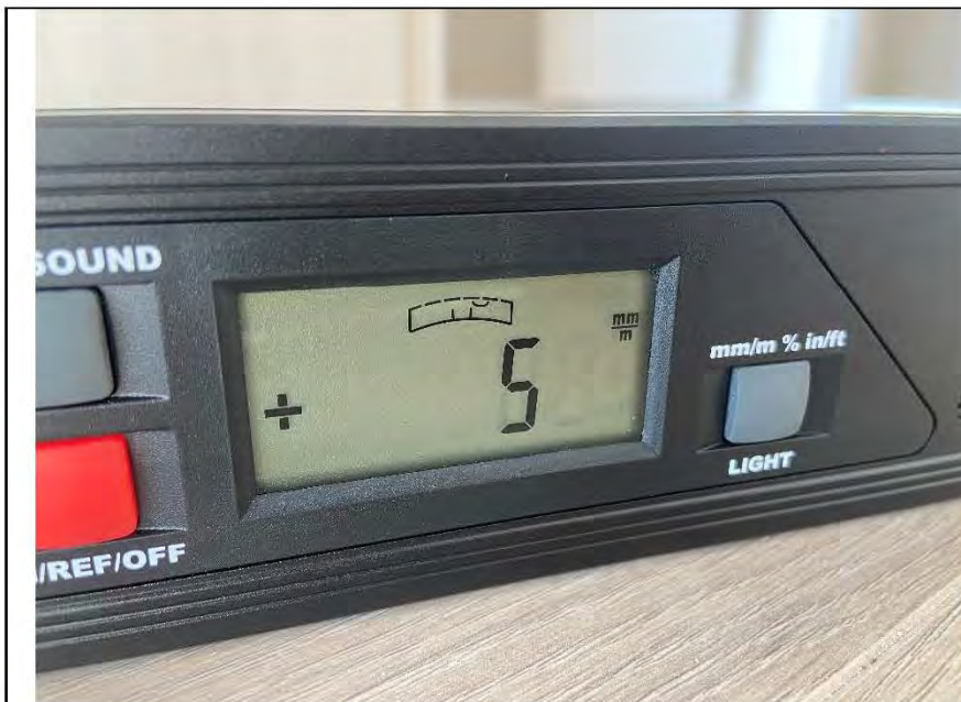
Фото №25. Отклонения поверхности напольного покрытия из ламината в спальне.
