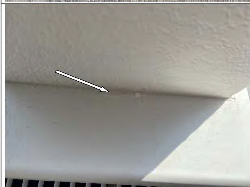
Фото №50. Дефект на лицевой стороне подоконной доски оконного блока ПВХ в кухне.
