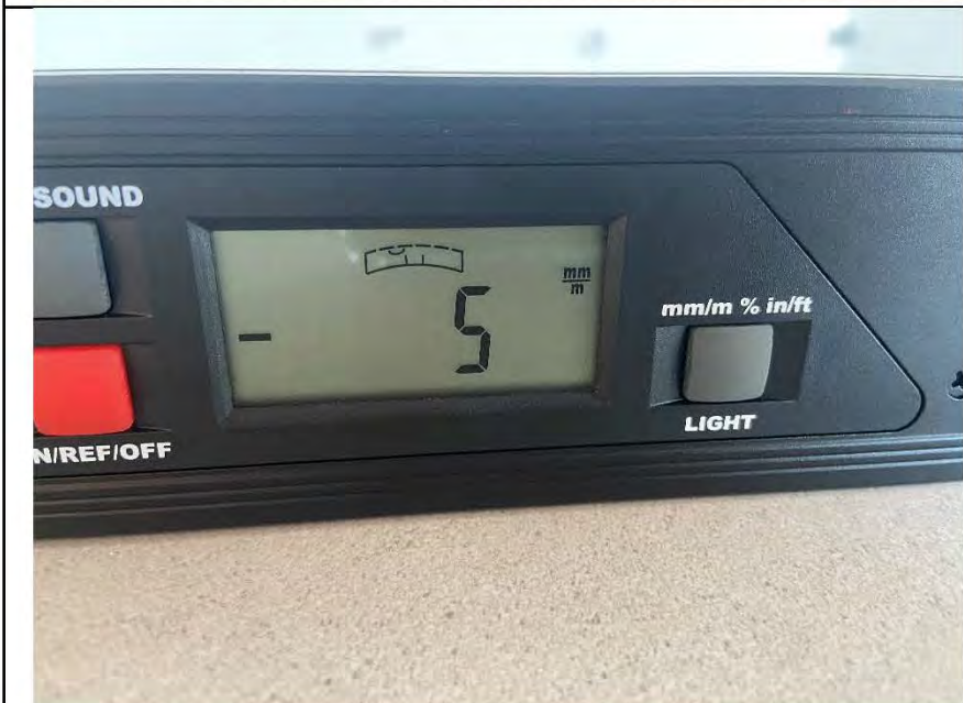
Фото №30. Отклонения поверхности напольного покрытия из керамической плитки в ванной комнате.
