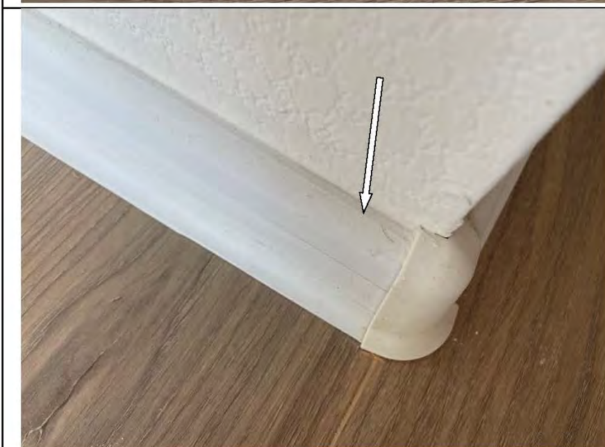
Фото №42. Дефект на напольном плинтусе ПВХ в кабинете.
