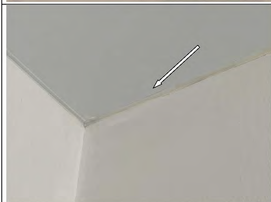
Фото №87. Дефект на поверхности натяжного потолка в кухне.
