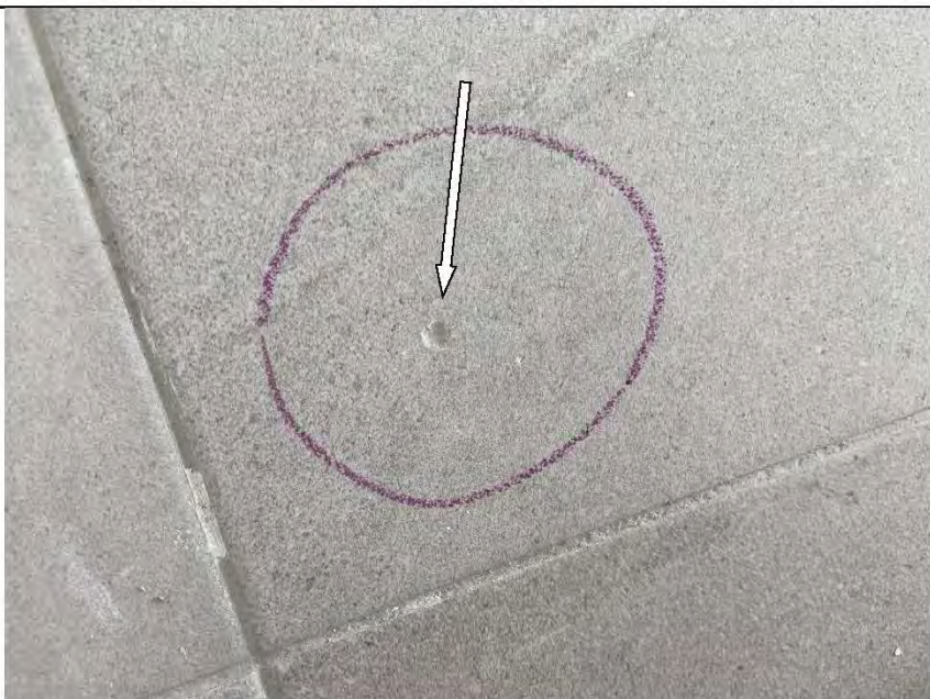
Фото №48. Механическое повреждение на поверхности напольного покрытия из керамической плитки в кухне.
