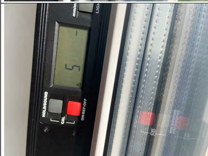
Фото №65. Отклонения от вертикали оконного блока ПВХ в кабинете.
