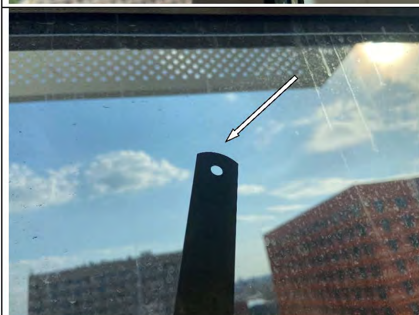
Фото №59. Царапина на стеклопакете оконного блока ПВХ в кабинете.
