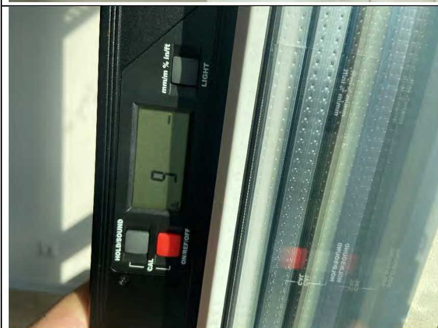
Фото №63. Отклонения от вертикали оконного блока ПВХ в кухне.
