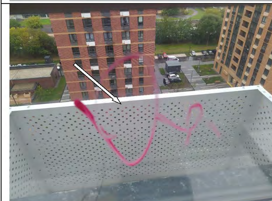
Фото №26. На стеклопакете оконного блока ПВХ в спальне имеется дефект (царапина).
