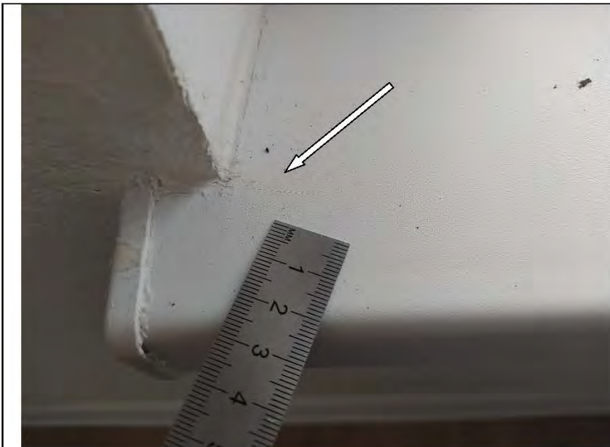
Фото №28. На лицевой поверхности подоконной доски в спальне имеются дефекты (царапины).
