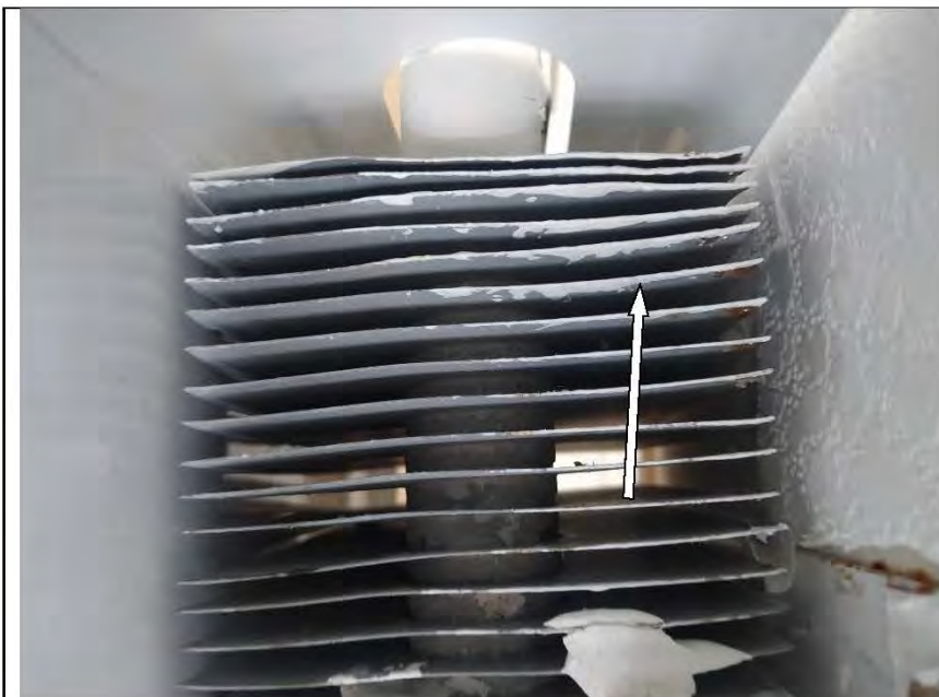
Фото №49. Радиатор в спальне имеет дефекты (замытия, загрязнения)
