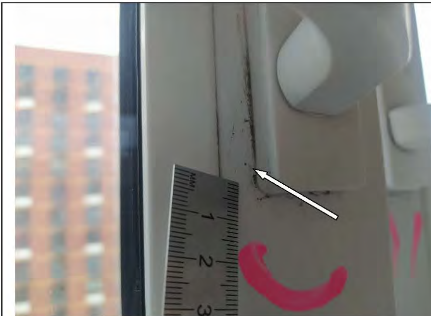
Фото №16. Профиль ПВХ оконного блока в спальне имеет дефекты (царапина).
