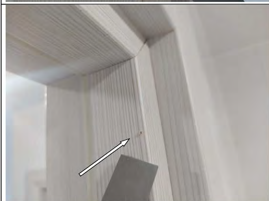
Фото №33. Коробка деревянного дверного блока в ванной комнате имеет дефекты (скол).
