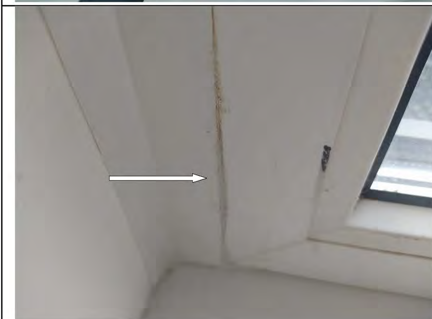
Фото №21. Профиль ПВХ оконного блока в кухне имеет дефекты (выпираание ПСУЛ ленты).
