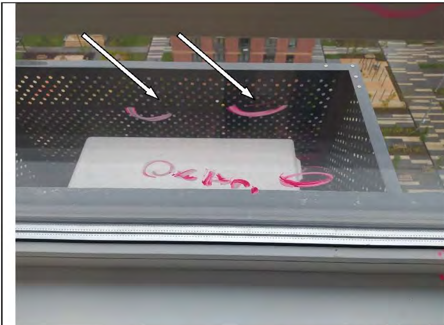
Фото №25. На стеклопакете оконного блока ПВХ в кухне имеется дефект (окалина).
