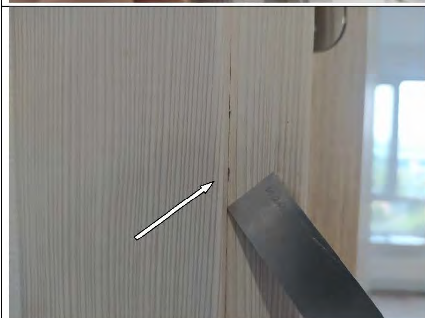
Фото №32. Коробка деревянного дверного блока в спальне имеет дефекты (сколы).
