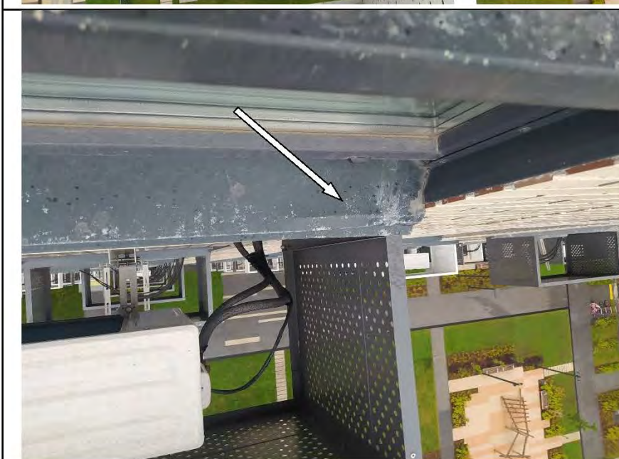
Фото №24. Металлический отлив оконного блока ПВХ в кухне имеет сильное замытие
