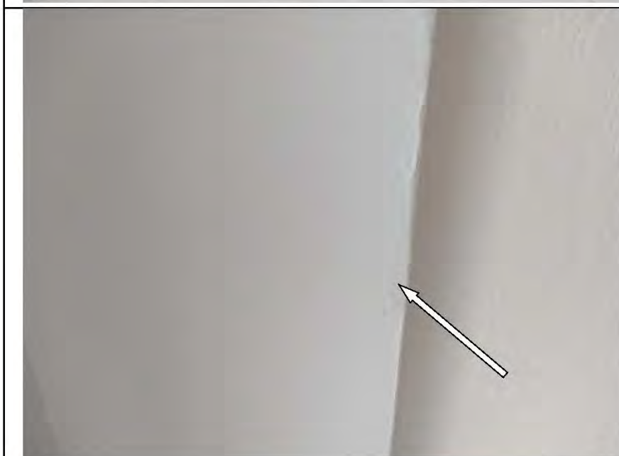
Фото №14. Окрашенные откосы оконного блока ПВХ в спальне выполнены с дефектами (подтеки).
