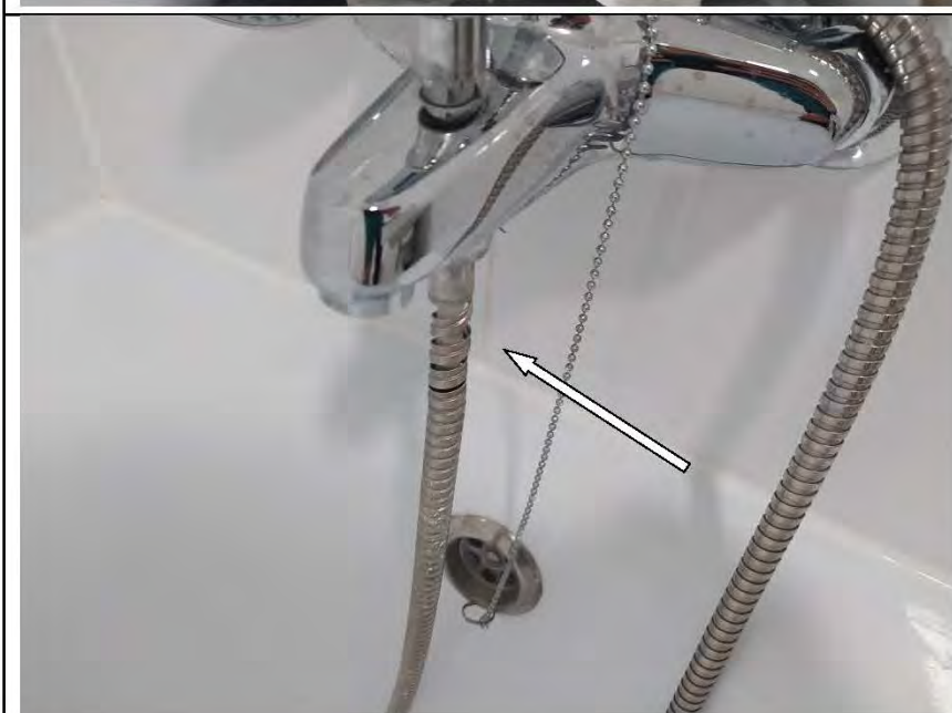
Фото №50. Дефекты на смесителе с душем в ванной комнате
