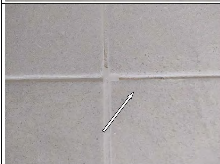
Фото №39. Затирка напольной плитки выполнена с нарушениями в кухне: неполное заполнение шовного пространства.
