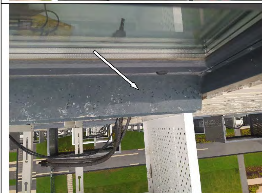
Фото №23. Металлический отлив оконного блока ПВХ в спальне имеет сильное замытие
