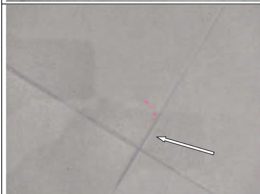
Фото №38. Затирка напольной плитки выполнена с нарушениями в прихожей: разность ширины шва.
