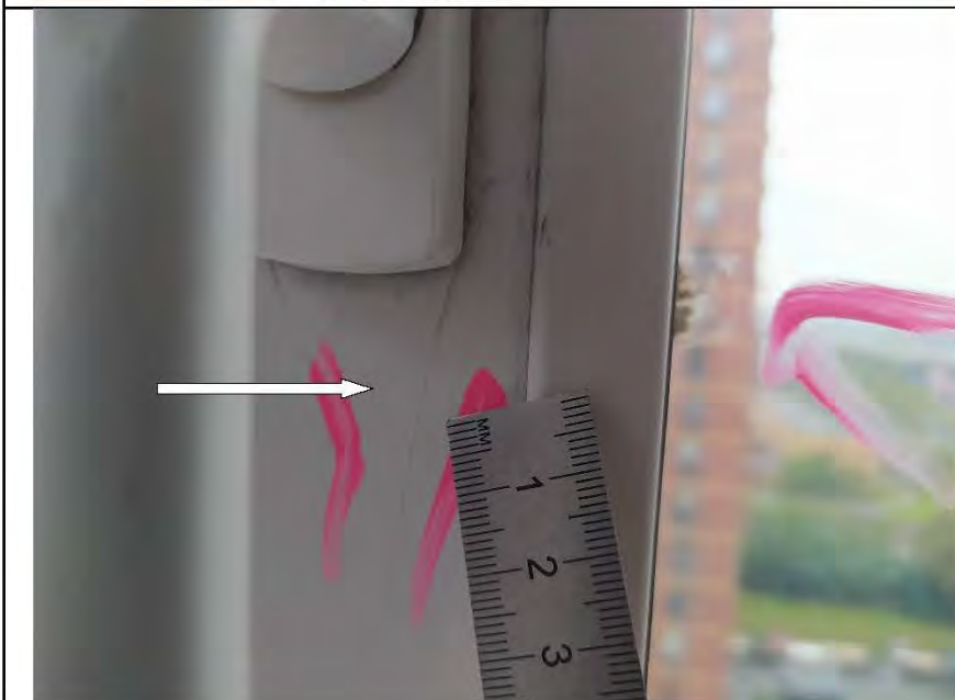
Фото №17. Профиль ПВХ оконного блока в спальне имеет дефекты (царапина).
