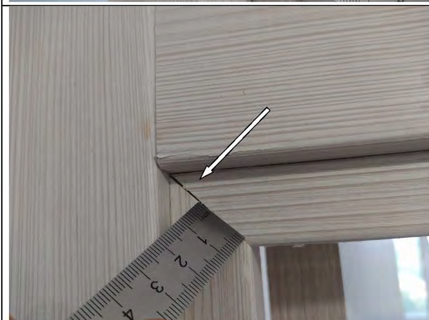
Фото №35. Элементы дверного блока (коробка) соединены не надежно в спальне
