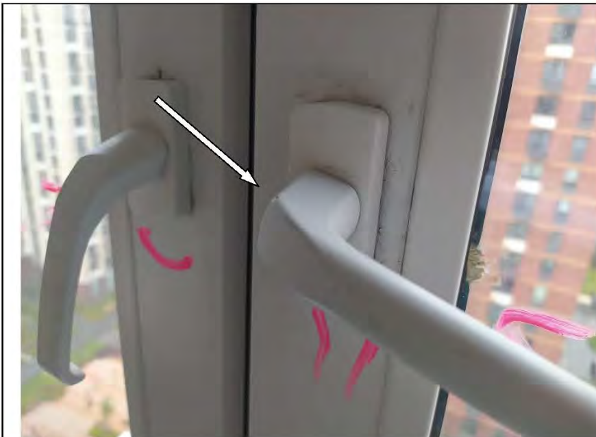
Фото №22. Сколы на фурнитуре оконного блока ПВХ в спальне (ручке).
