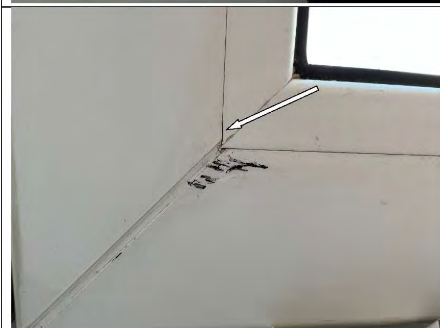
Фото №48. Зазор в стыке профилей ПВХ оконного блока в детской.
