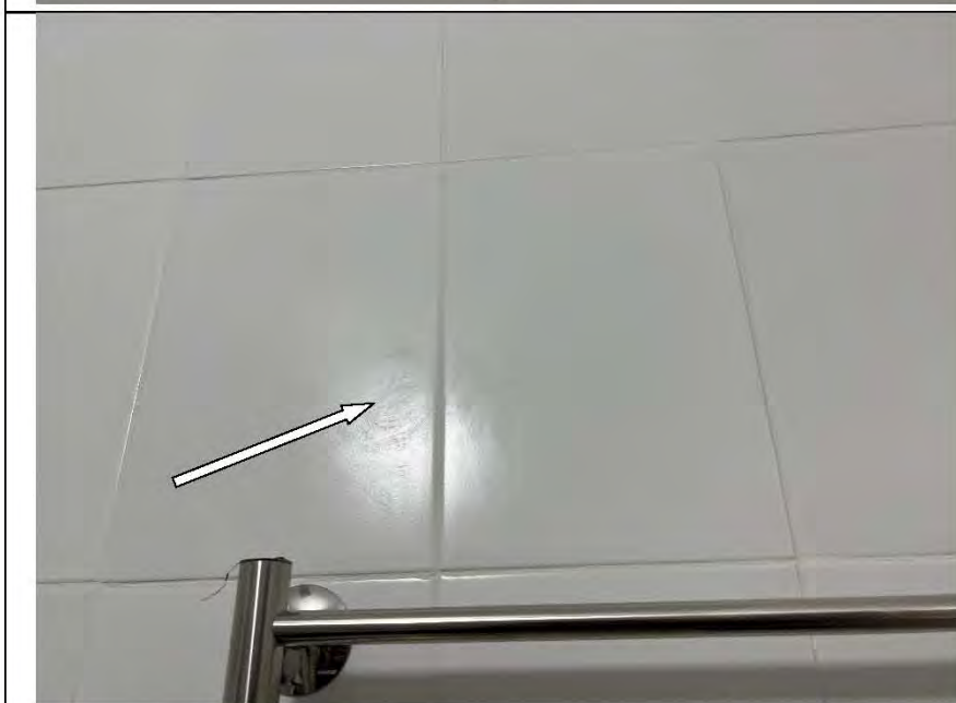
Фото №26. Загрязнения настенной керамической плитки в ванной комнате.
