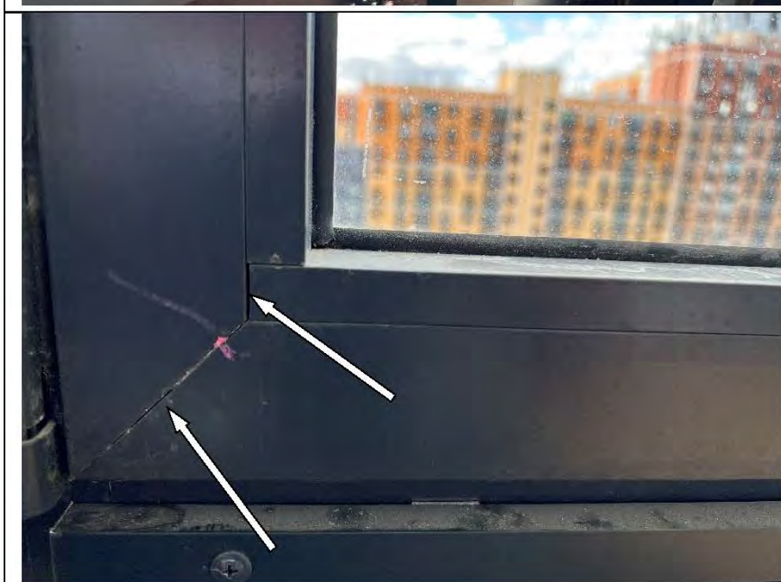
Фото №51. Зазор в стыке профилей металлического оконного блока на лоджии.
