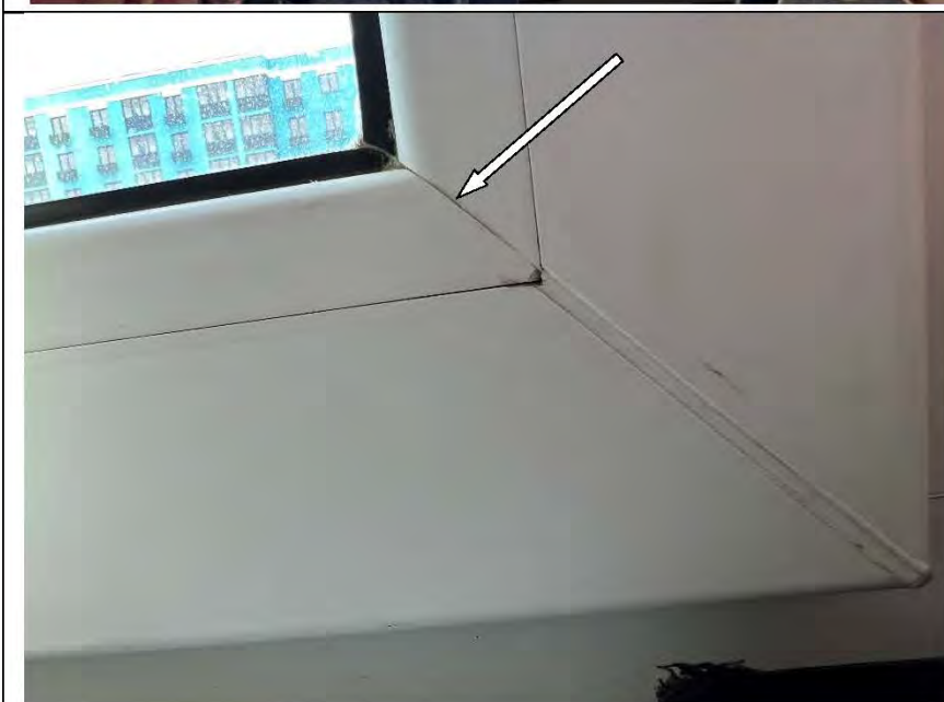
Фото №47. Зазор в стыке профилей ПВХ оконного блока в кухне.
