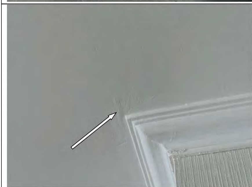
Фото № 54. Подтеки краски на потолке в кухне.
