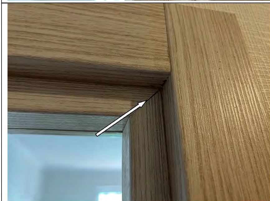
Фото № 60. Элементы дверного блока соединены не надежно в детской (коробка).
