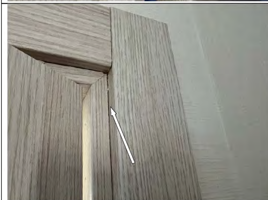
Фото № 62. Элементы дверного блока соединены не надежно в гостиной (коробка).
