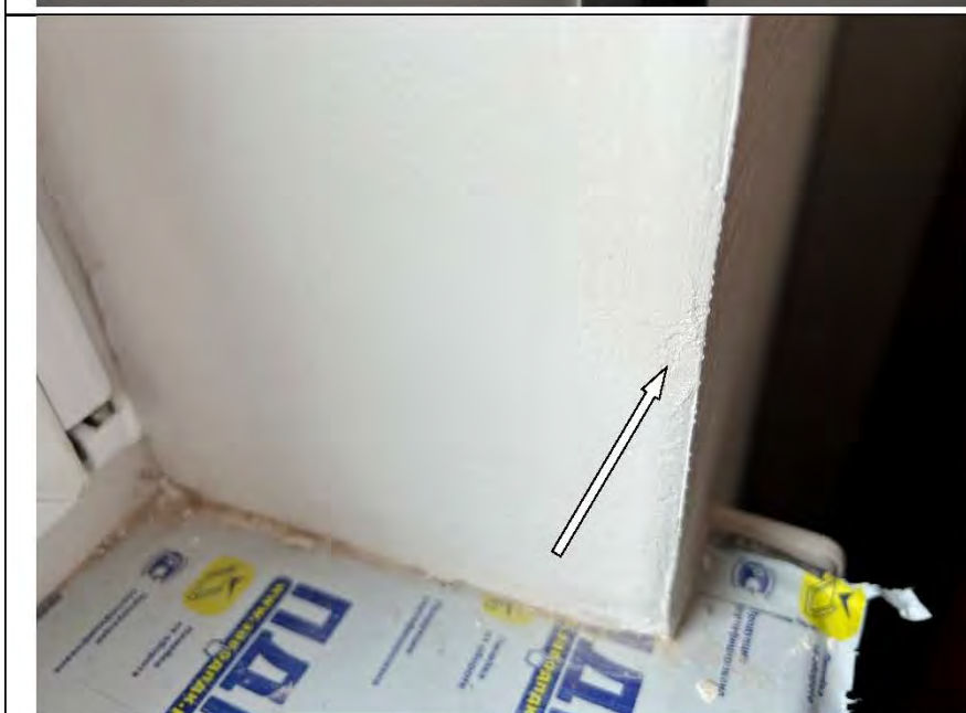
Фото №39. Подтеки краски на откосе оконного блока ПВХ в кухне.
