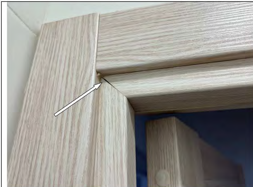
Фото № 61. Элементы дверного блока соединены не надежно в санузле (коробка).
