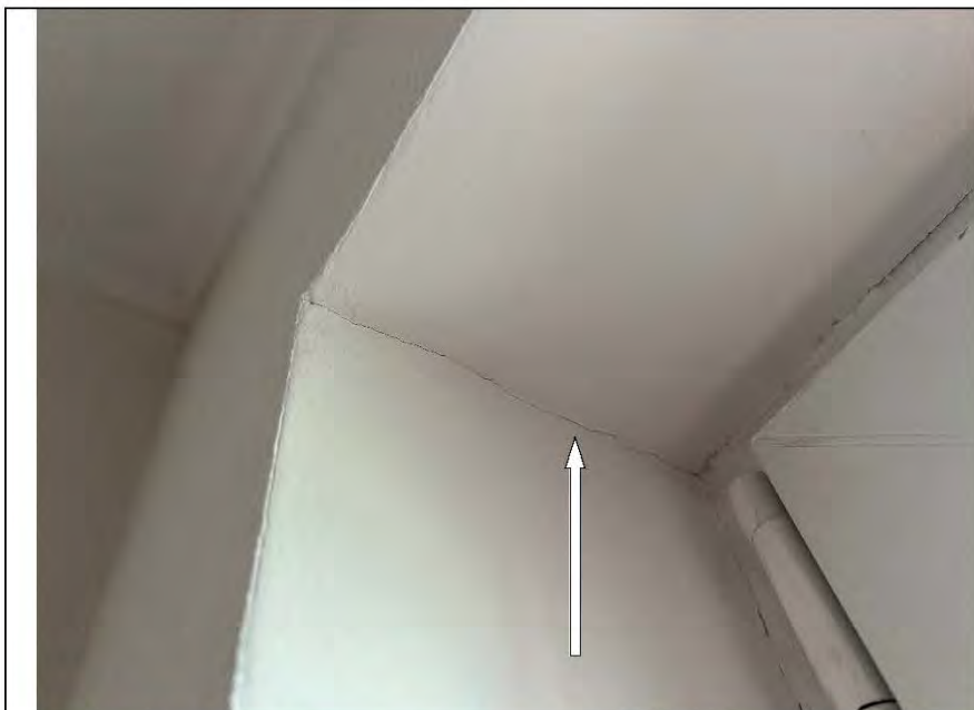
Фото №43. Трещина на откосе оконного блока ПВХ в гостиной.
