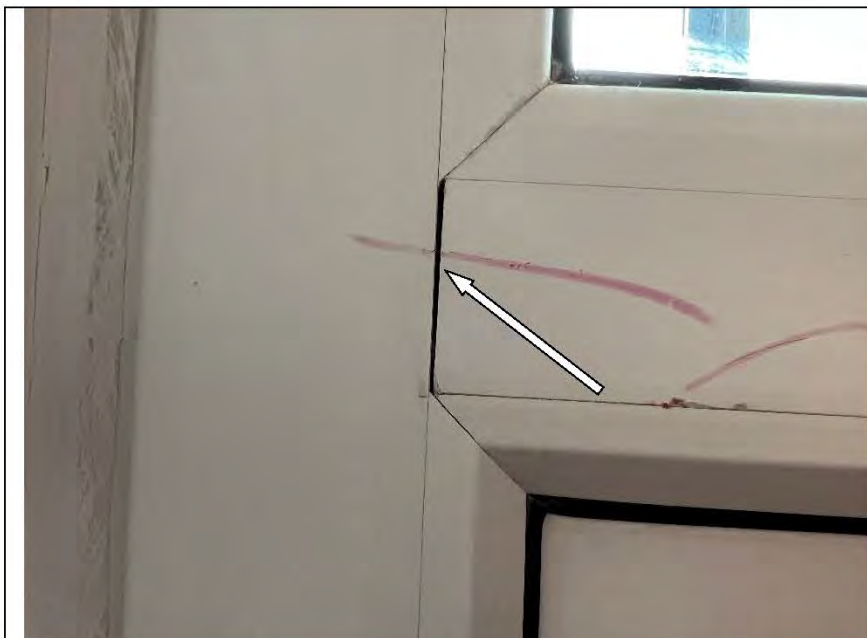
Фото №49. Зазор в стыке профилей ПВХ оконного блока в гостиной.
