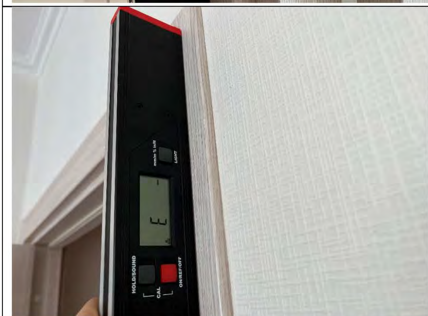
Фото № 71. Отклонение наличников дверного блока в спальне равно 3 мм.
