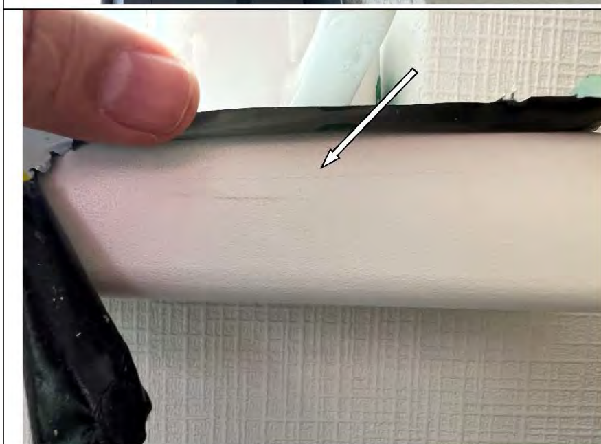
Фото №36. Царапина на лицевой поверхности подоконной доски в кухне.
