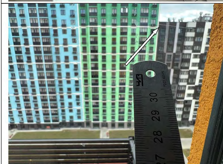
Фото №44. Царапина на стеклопакете оконного блока ПВХ в кухне.
