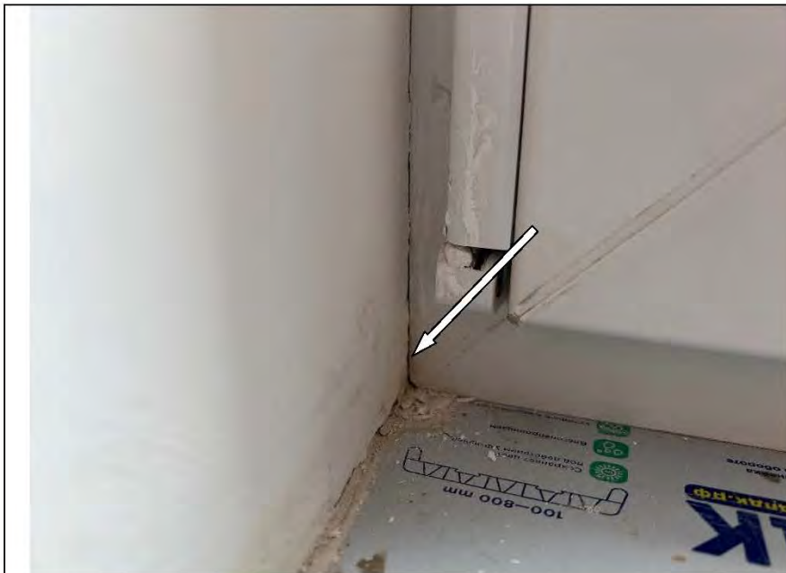
Фото №34. Щель в стыке откосов и оконного блока ПВХ в кухне.
