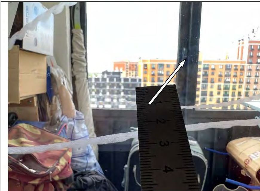
Фото №46. Царапина на стеклопакете оконного блока ПВХ в гостиной.
