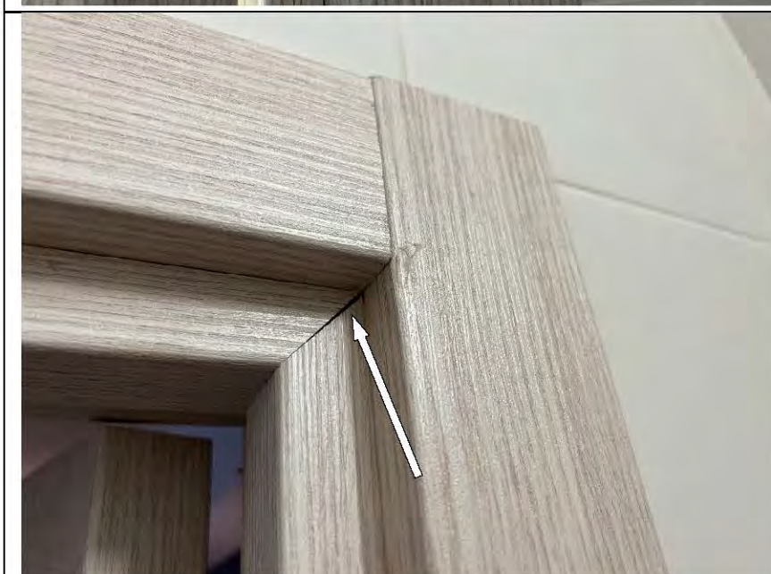
Фото № 63. Элементы дверного блока соединены не надежно в ванной комнате (коробка).
