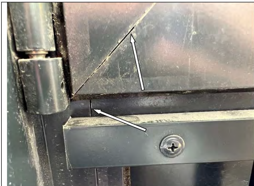
Фото № 52. Зазор в стыке профилей металлического оконного блока на лоджии.
