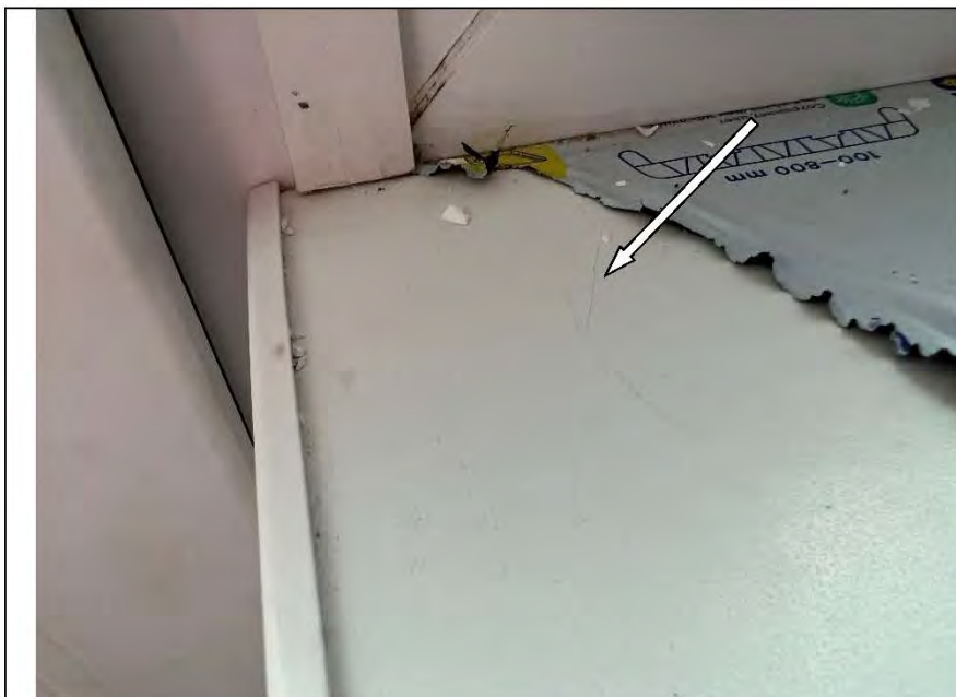
Фото №37. Царапина на лицевой поверхности подоконной доски в гостиной.
