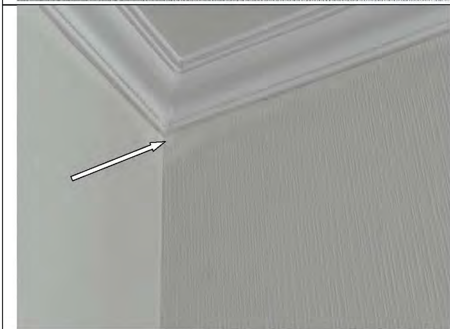
Фото №21. Загрязнение обойного полотна в спальне.
