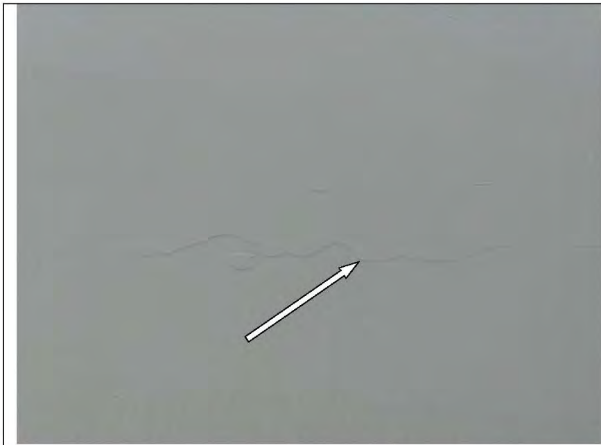
Фото № 58. Подтеки краски на потолке на лоджии.
