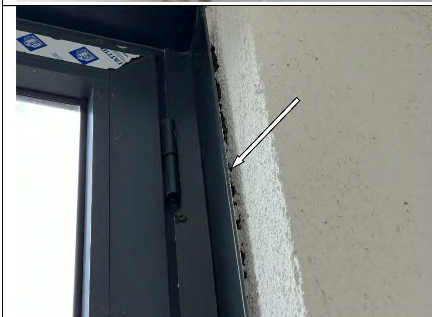
Фото №35. Щель между нащельником и откосом оконного металлического блока на лоджии.
