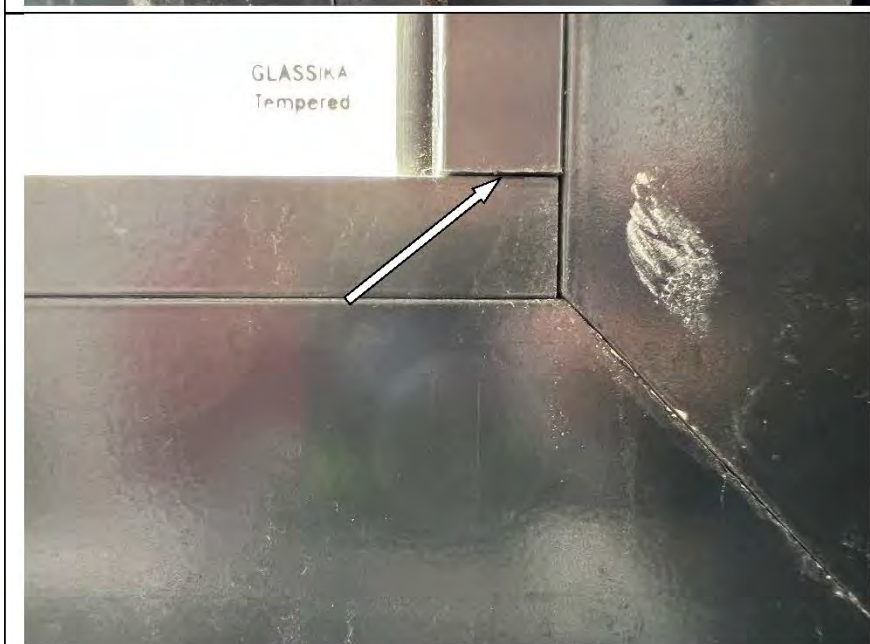
Фото № 53. Зазор в стыке профилей металлического оконного блока на лоджии.
