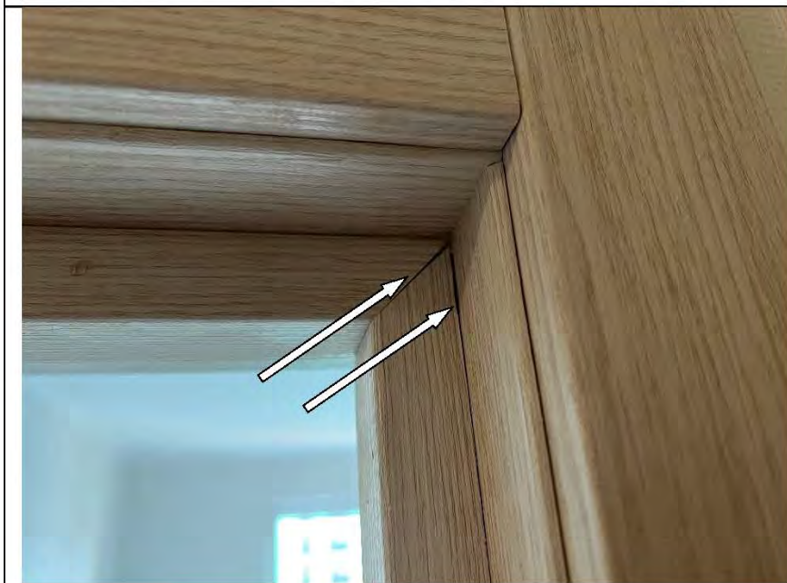
Фото № 59. Элементы дверного блока соединены не надежно в кухне (коробка).
