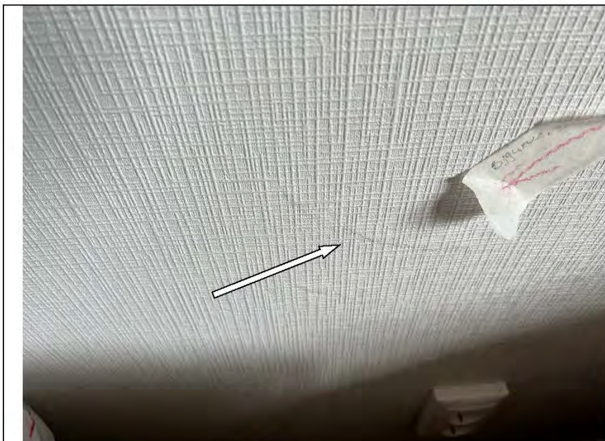
Фото №22. Вздутие обойного полотна в кухне.
