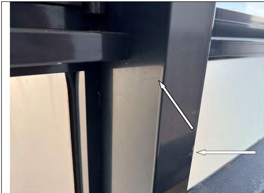
Фото №64. Царапины на металлическом профиле оконного блока на балконе.
