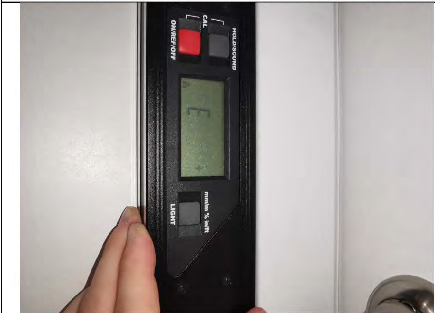
Фото №53. Отклонение коробки входного дверного блока.
