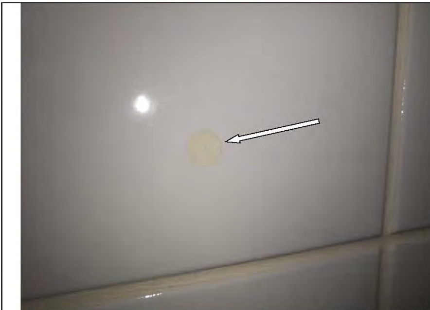
Фото №16. Механическое повреждение настенной керамической плитки в ванной комнате.
