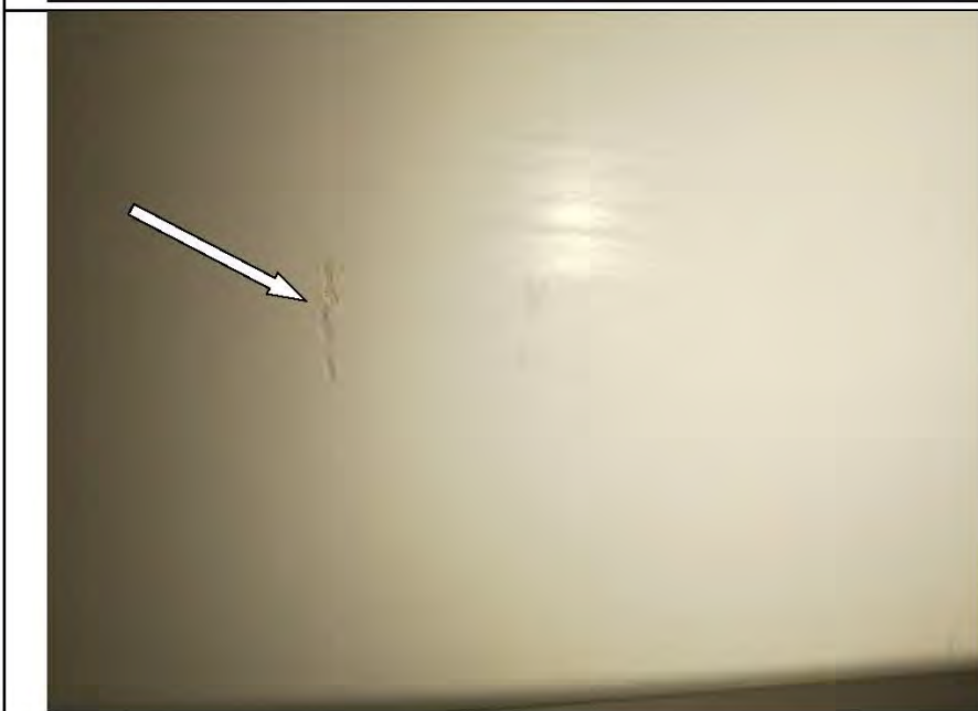
Фото №33. Царапины на профиле ПВХ оконного блока в спальне.
