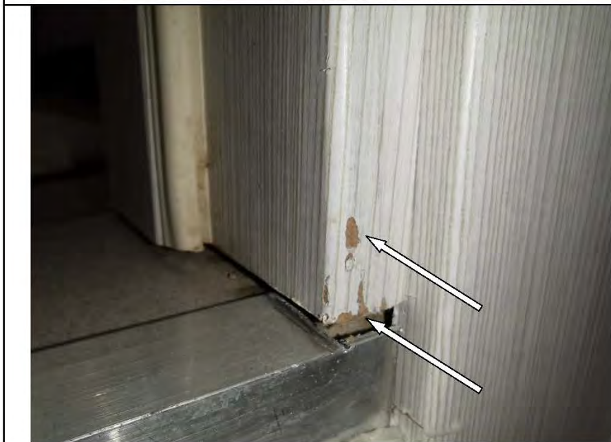
Фото №44. Повреждение ламинации короба деревянного дверного блока в ванной комнате.
