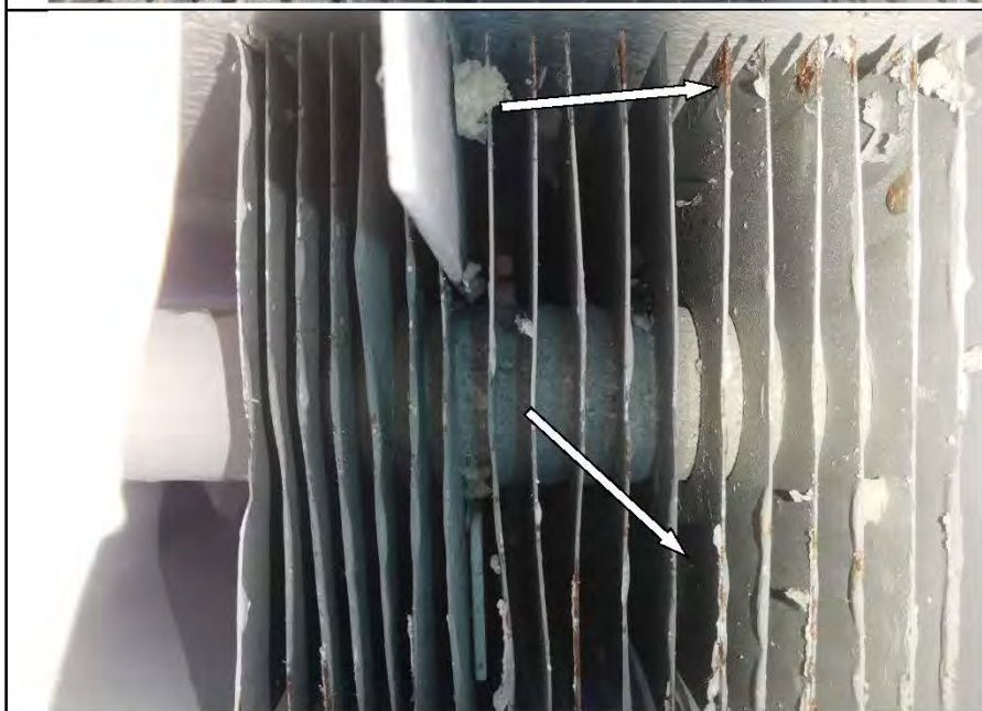
Фото №57. Радиатор в спальне имеет дефекты (коррозия, загрязнения).
