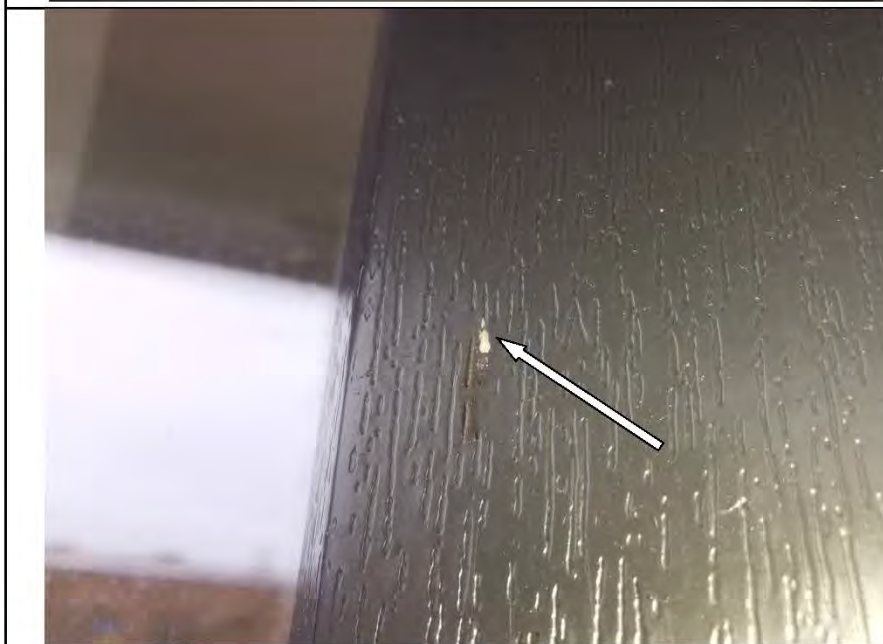
Фото №38. Потертости на профиле ПВХ оконного блока в кухне.
