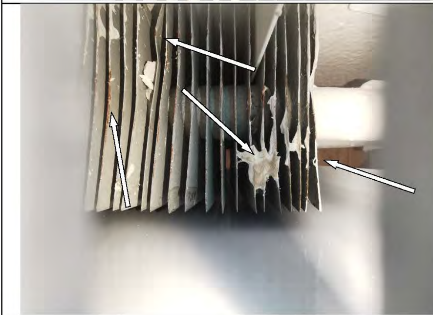
Фото №59. Радиатор в кухне имеет дефекты (коррозия, замятия, загрязнения).
