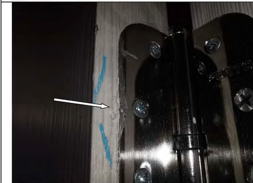
Фото №47. Повреждение ламинации полотна деревянного дверного блока в спальне.
