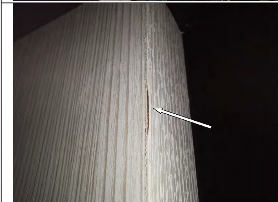
Фото №48. Повреждение ламинации полотна деревянного дверного блока в спальне.
