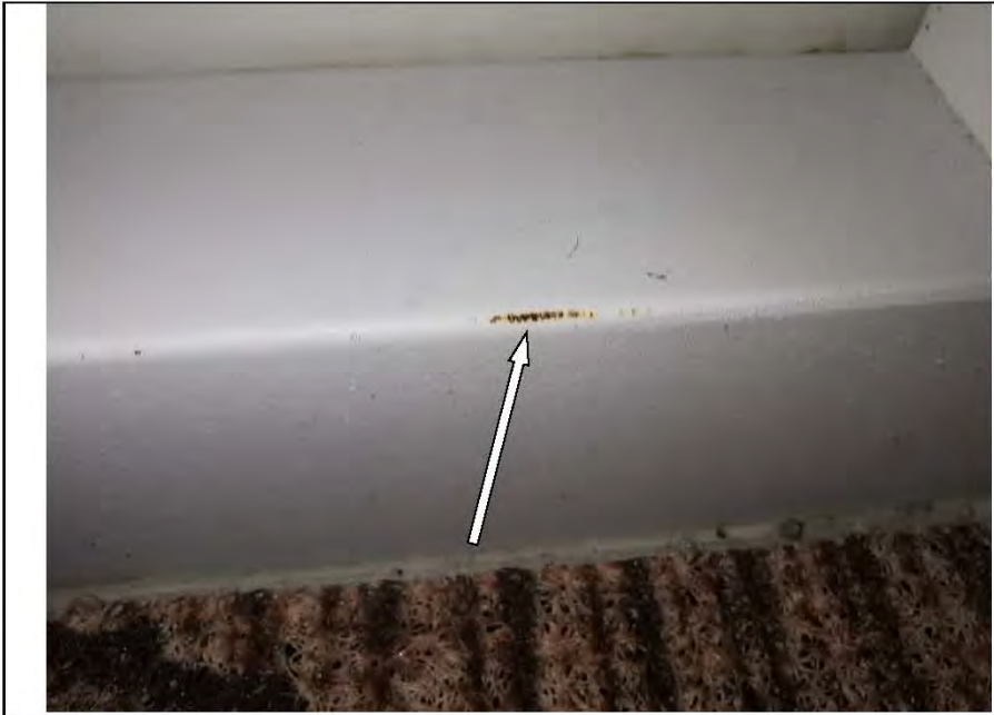
Фото №52. Коррозия на коробе входного дверного блока.
