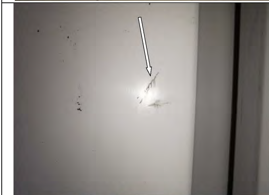
Фото №35. Царапины на профиле ПВХ оконного блока в кухне.
