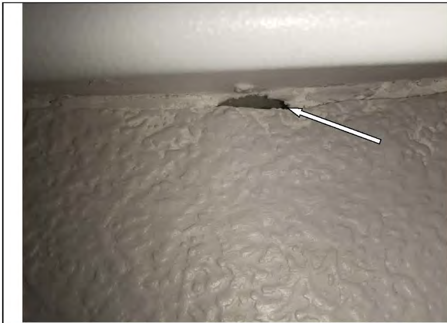
Фото №43. Отверстие под подоконником в кухне не загерметизировано.
