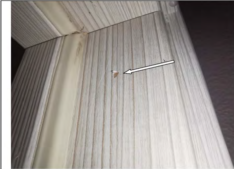
Фото №46. Повреждение ламинации короба деревянного дверного блока в спальне.
