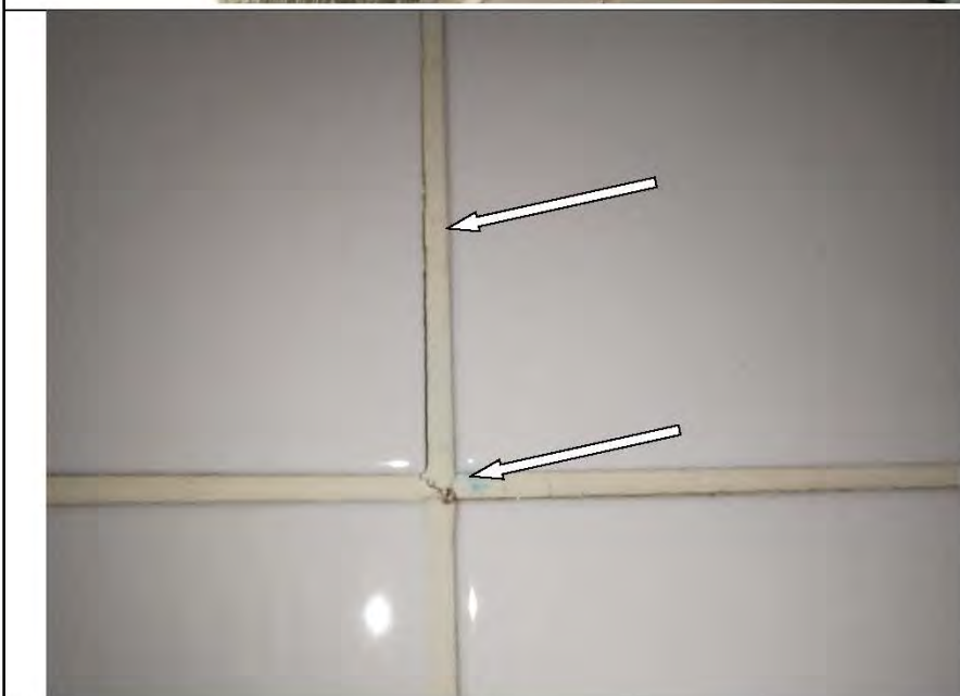
Фото №15. Затирка настенной плитки в ванной комнате выполнена с нарушениями.
