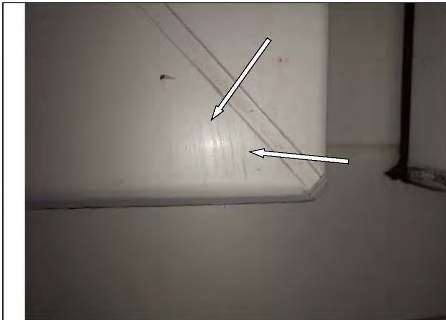
Фото №37. Царапины на профиле ПВХ оконного блока в кухне.
