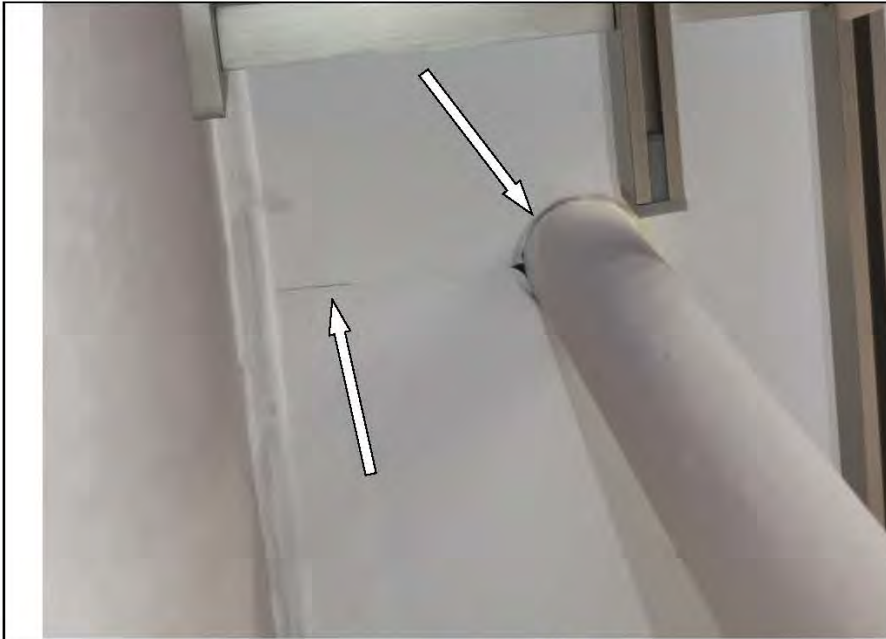
Фото №31. Разрезы в месте прохода труб отопления не закрыты декоративными пластиковыми обводами в спальне.
