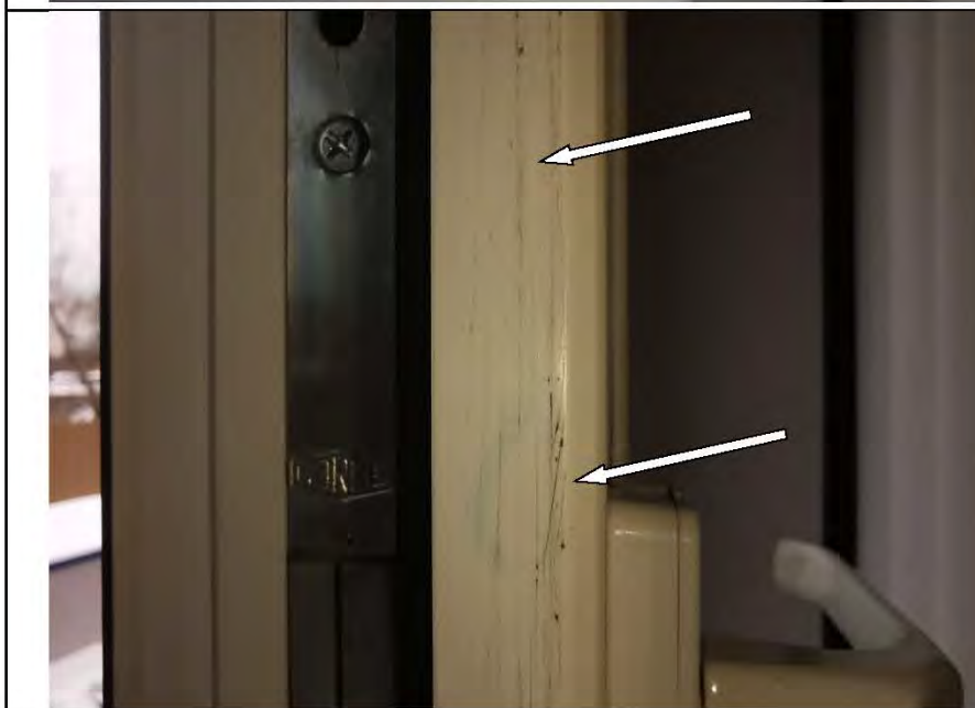
Фото №36. Царапины на профиле ПВХ оконного блока в кухне.
