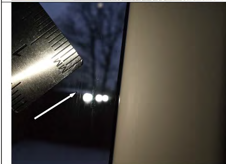
Фото №39. Царапины на стеклопакете оконного блока ПВХ в кухне.
