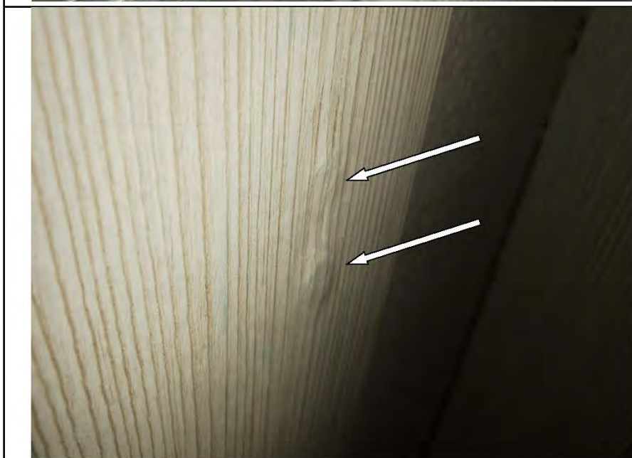
Фото №45. Повреждение ламинации наличников деревянного дверного блока в ванной комнате.
