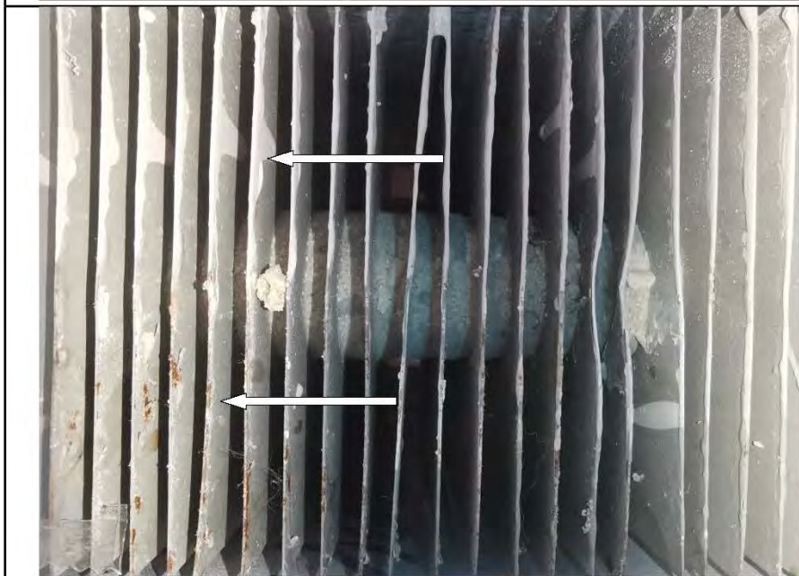
Фото №56. Радиатор в спальне имеет дефекты (коррозия, загрязнения).
