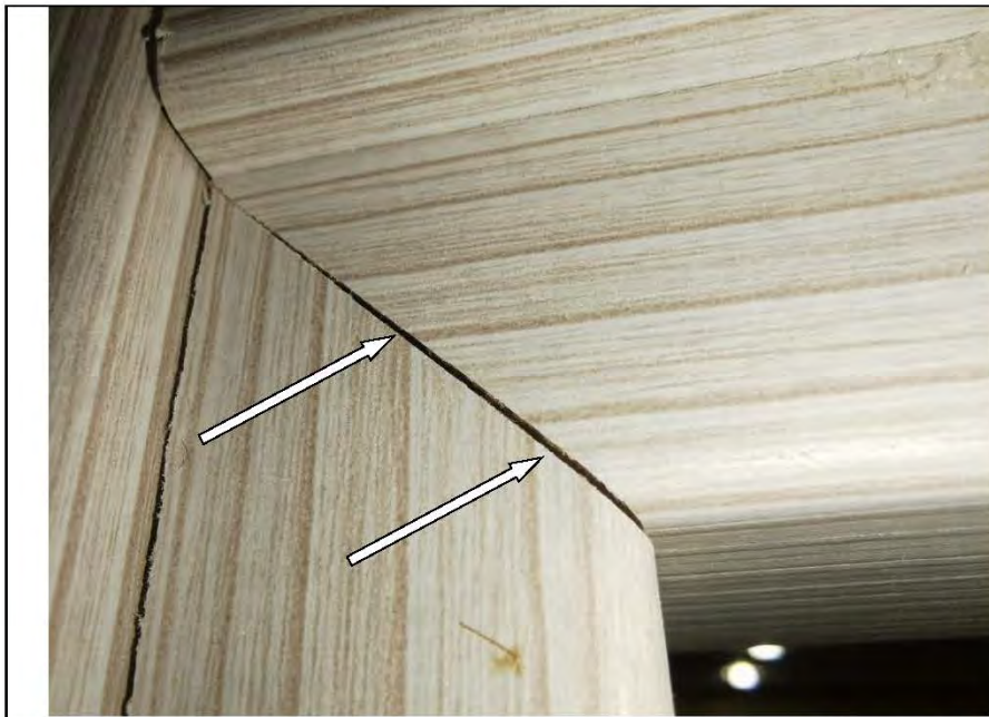
Фото №49. Элементы дверного блока (коробка) соединены не надежно в ванной комнате.
