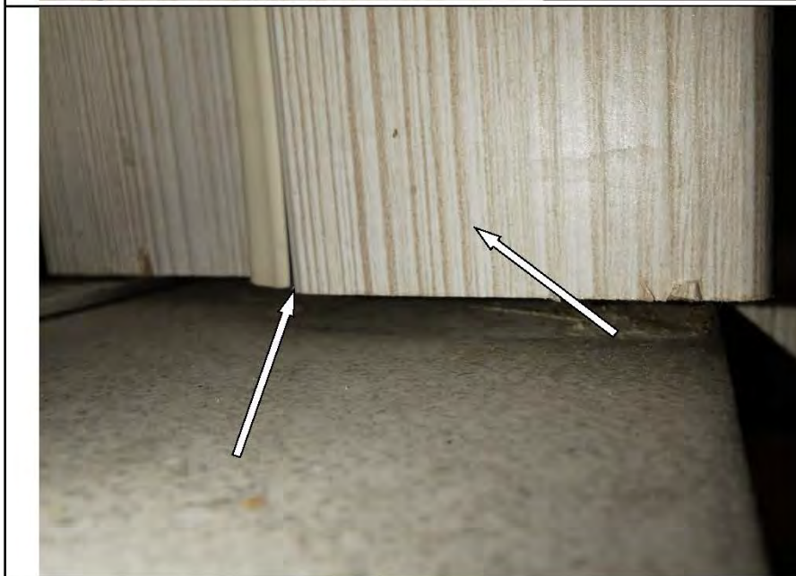
Фото №50. Коротко подрезан короб деревянного дверного блока в ванной комнате.
