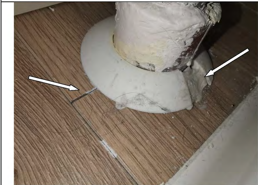
Фото №23. Заделка отверстия для трубопровода отопления в напольном покрытии из ламината выполнена с дефектом в кухне.
