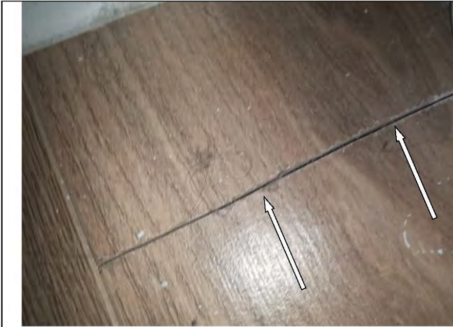
Фото №22. Зазор между соседними досками ламината, сколы на ламинате в спальне.
