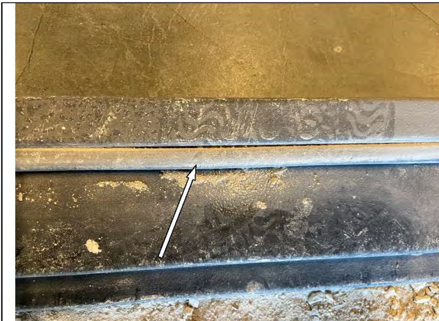
Фото №13. Дефект на противопожарной уплотнительной ленте входного комбинированного дверного блока в квартире.
