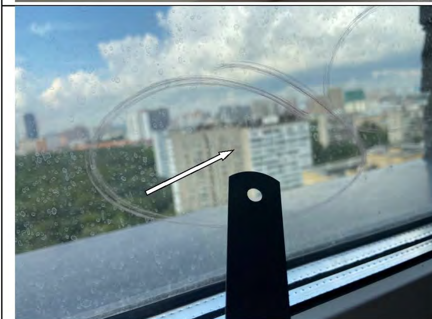
Фото №21. Царапина на стеклопакете оконного блока ПВХ в квартире.
