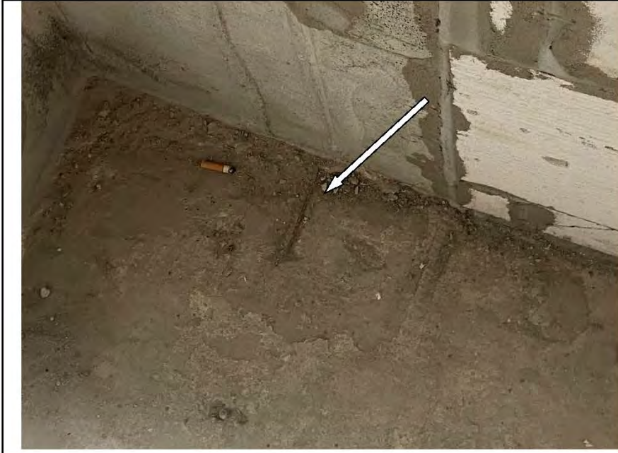
Фото №28. Оголение рабочей арматуры в квартире.
