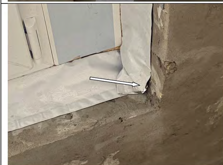
Фото №15. Инfiltrация воздуха и влаги оконного блока ПВХ в квартире.
