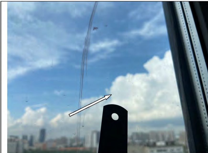
Фото №22. Царапина на стеклопакете оконного блока ПВХ в квартире.
