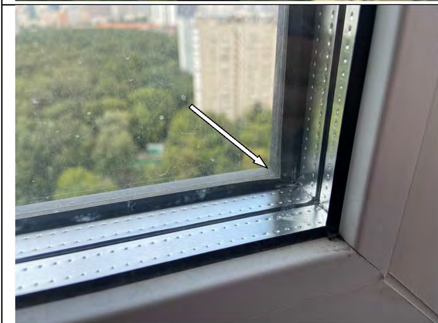
Фото №24. Дефект на уплотнительной ленте оконного блока ПВХ в квартире.
