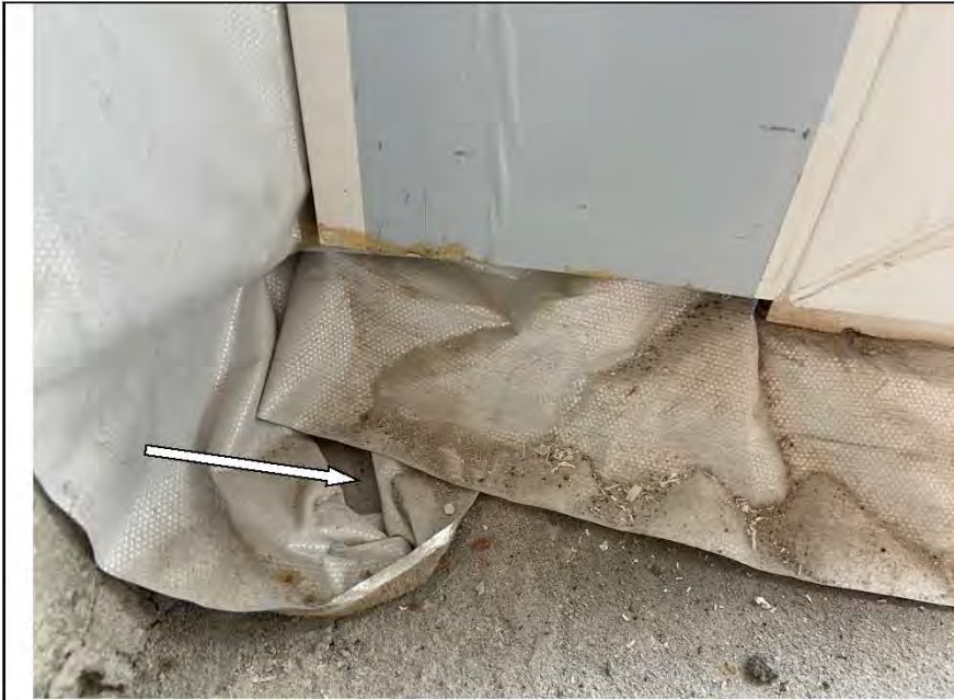
Фото №16. Инfiltrация воздуха и влаги оконного блока ПВХ в квартире.
