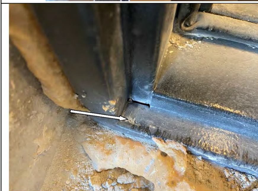
Фото №8. Дефект на коробке входного комбинированного дверного блока в квартире.
