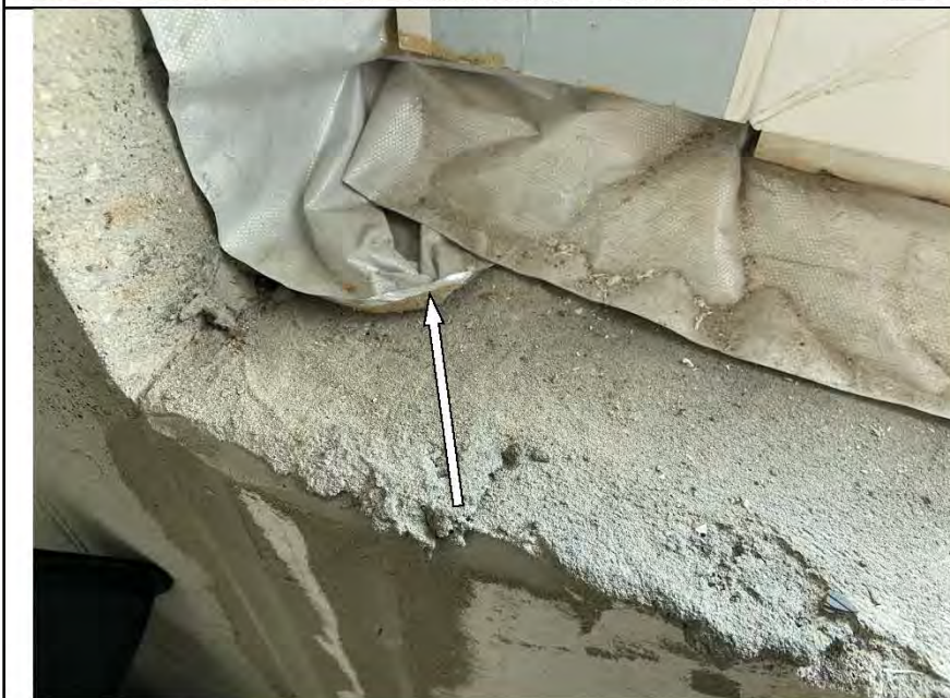
Фото №17. Инfiltrация воздуха и влаги оконного блока ПВХ в квартире.
