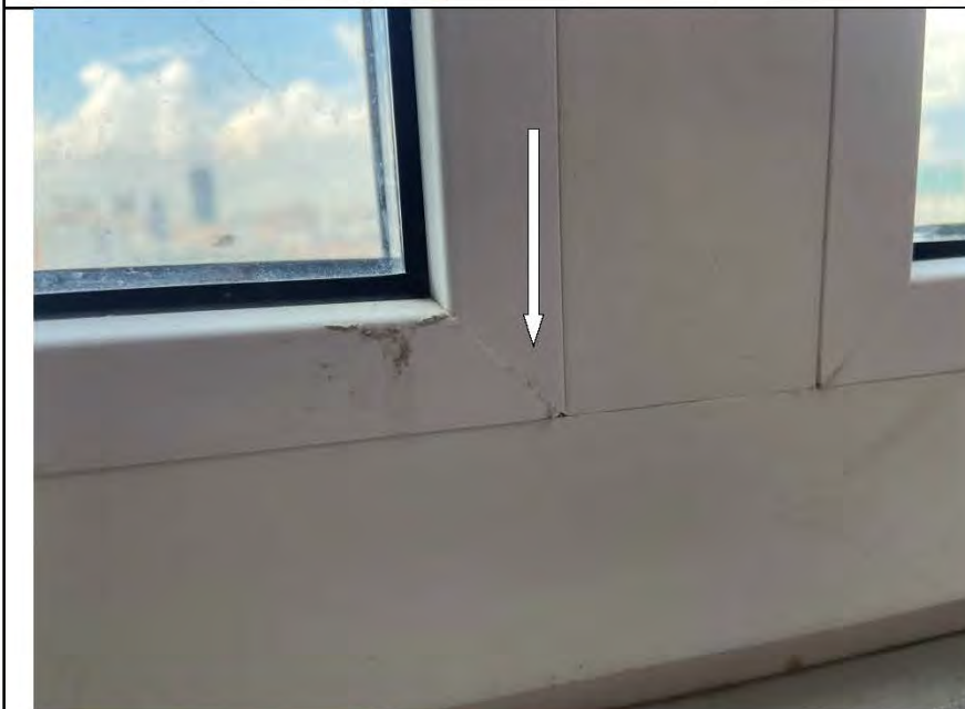
Фото №20. Царапина на профиле оконного блока ПВХ в квартире.
