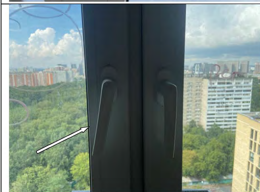
Фото №26. Не отрегулирована фурнитура оконного блока ПВХ в квартире.
