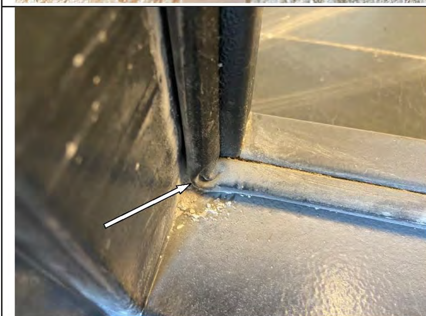
Фото №12. Дефект на противопожарной уплотнительной ленте входного комбинированного дверного блока в квартире.
