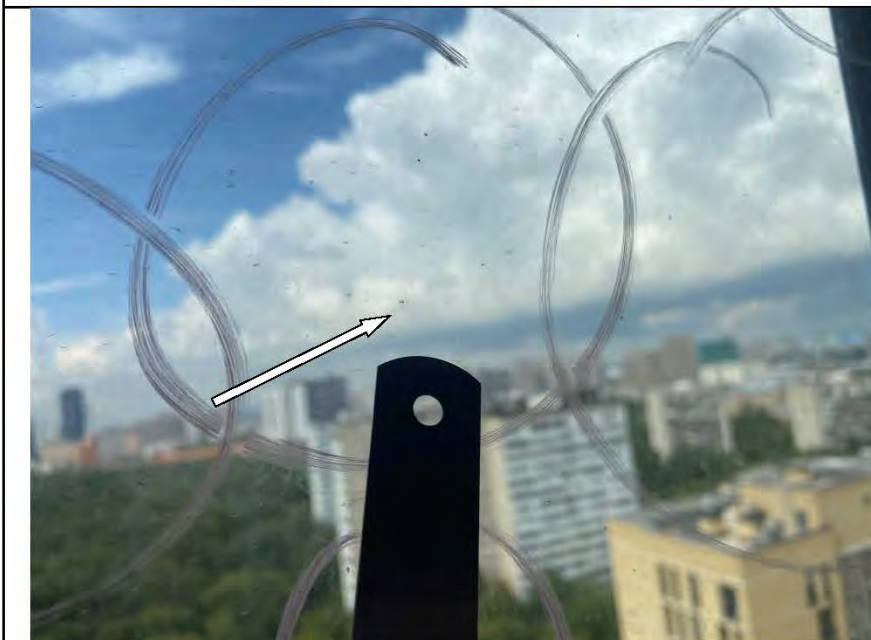
Фото №23. Царапина на стеклопакете оконного блока ПВХ в квартире.
